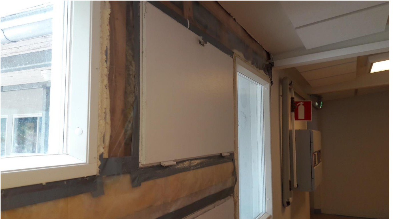
Käytävän puutteellista höyrynsulkua.
