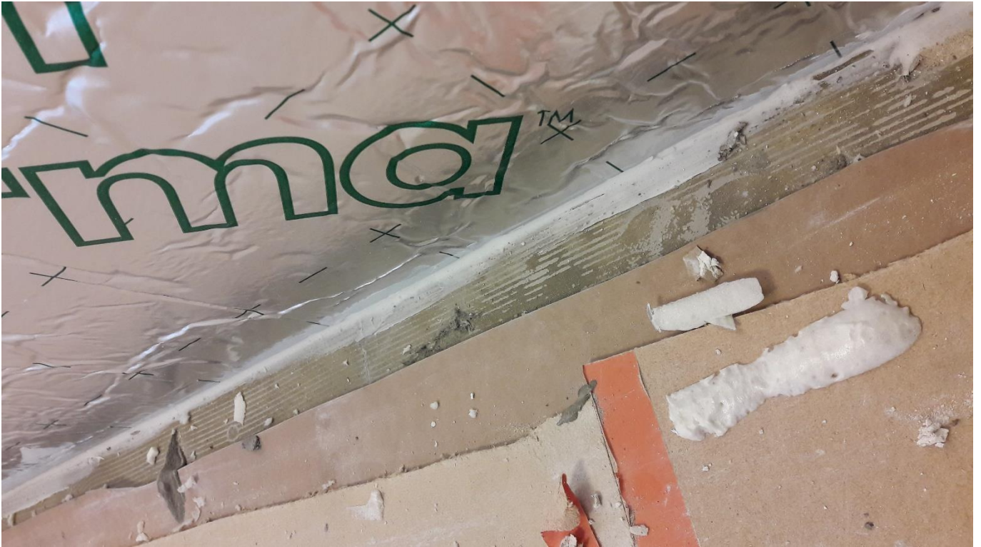
Lattiaraja kitattiin tiivistysmassalla, jonka jälkeen uretaanilevyn päälle asennettiin kipsilevy, johon nostettiin uusittu osa lattiamattoa.
