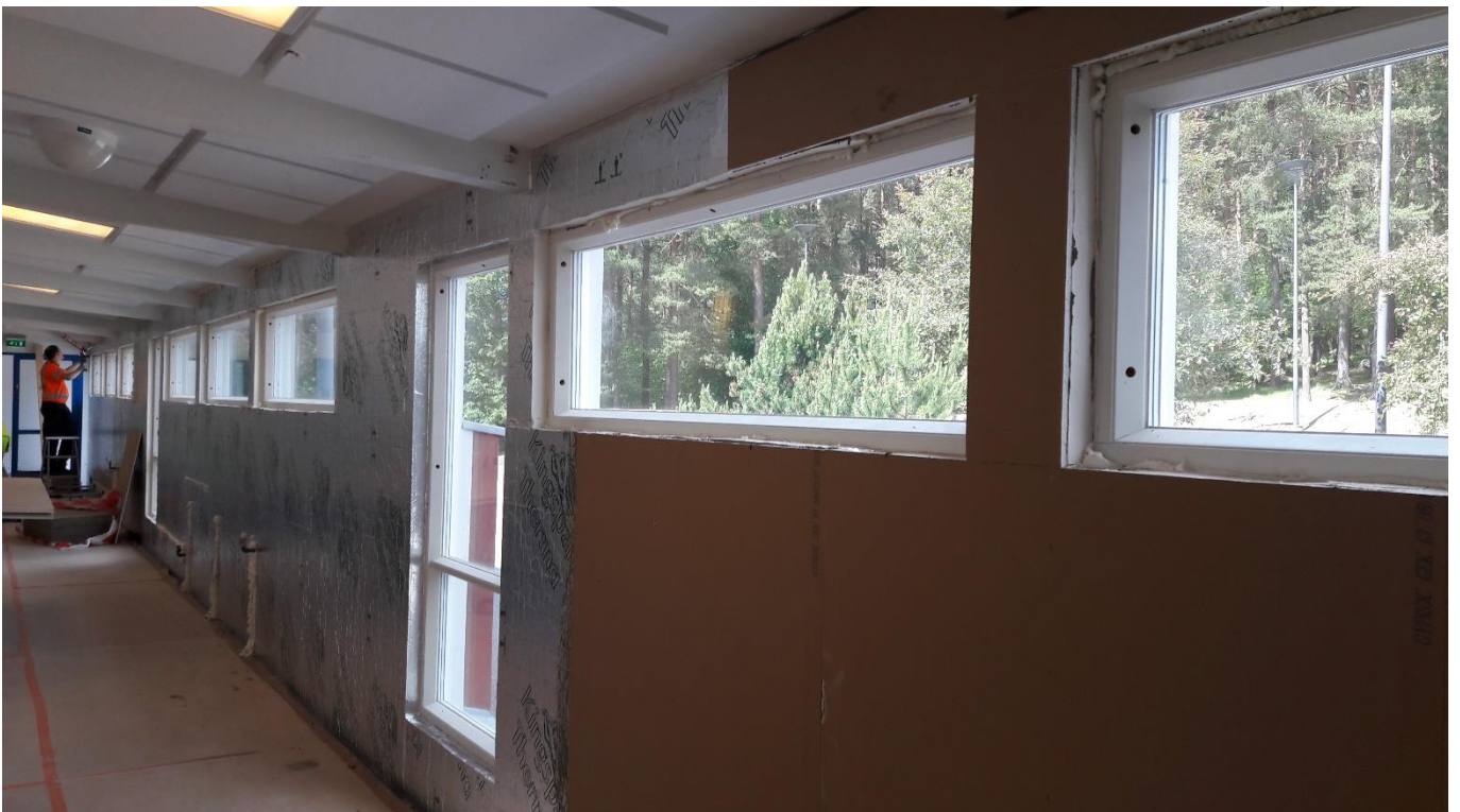
Käytäväseinällä asennettuna uretaanilevy.
