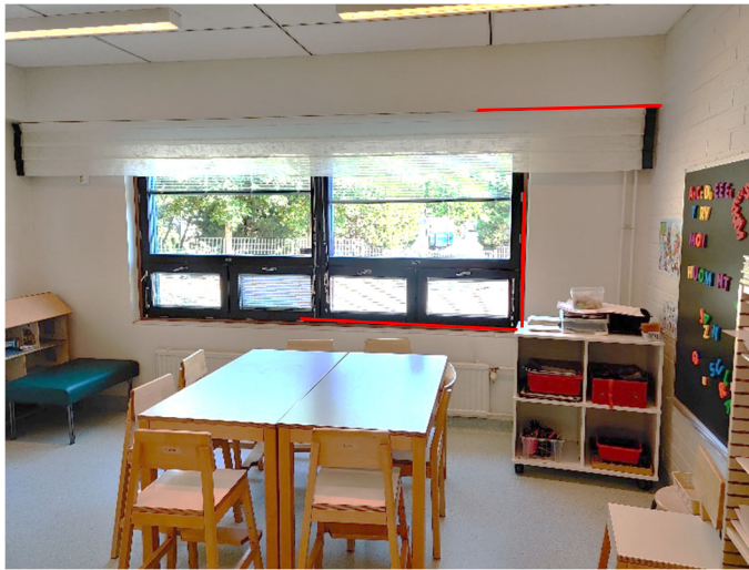
Kuva 4. Tilassa 125 todettiin merkittäviä ilmavuotoja ikkunaliittymissä sekä verhokotelon takaa
