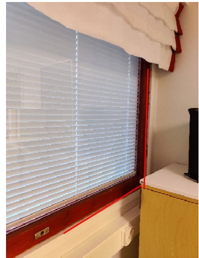
Kuva 5. Tilassa 135 todettiin merkittäviä ilmavuotoja ikkunaliittymissä sekä vähäistä vuotoa lattianrajasta
