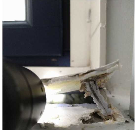
Kuva 5.9. Tiivistyksiä ei ole tehty myöskään ikkunanapenkin ja ikkunan liittymään. Tila 4114.
