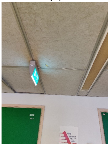
Kuva 6.14. Kellari kerroksen tilojen katoissa on vanhoja akustiikkalevyjä, joista voi irrota kuituja
