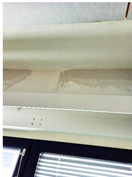
Kuva 5.4. Valumajälkiä ikkunan yläpuolella tilassa 2118. Välipohjan liittymää on korjattu.
