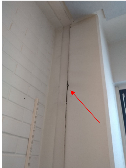
Kuva 5.5. Liikuntasauaman suojapelti on irti varastotilassa 1116. Liikuntasauamasta puuttuu elastinen massa. Pellin takaa on suora ilmayhteys eristetilaan.
