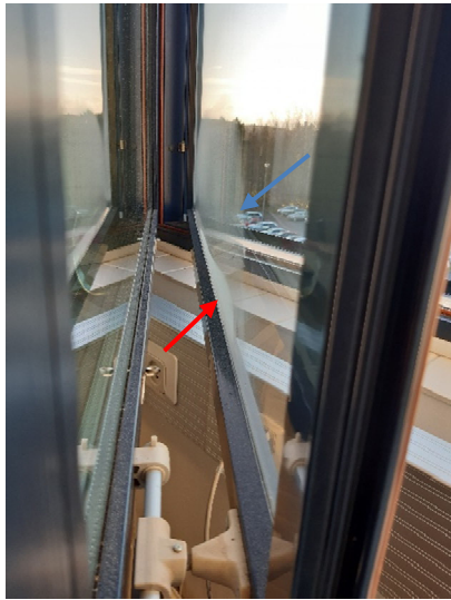
Kuva 5.13. Käyttäjän ottama kuva ikkunan huurtumisesta 4.11.2020. Huurtumista esiintyy uloimman lasin sekä sisä- että ulkopinnoilla.
