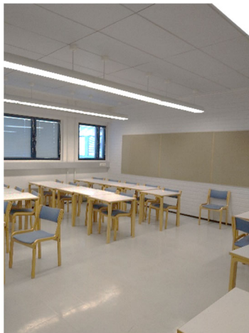
Kuva 6.12. Ensimmäisen kerroksen tilojen katoissa on vanhoja akustiikkalevyjä, joista voi irrota kuituja (kuva tilasta 1115)
