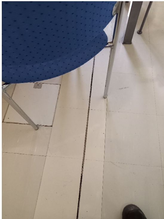
Kuva 5.14. Liikuntasauomaista puuttuu tiivistemassaa. Tilasta 4123 on suora ilmayhteys tilaan 3123.
