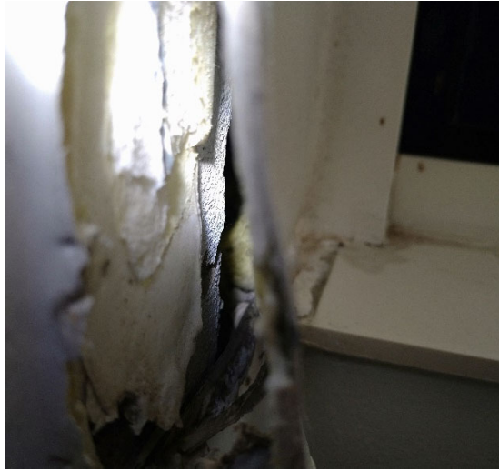
Kuva 5.8. Peitelevyn alla ei ole tiivistyksiä lainkaan. Ulkoseinän eristetila on suoraan näkyvissä. Tila 4114.
