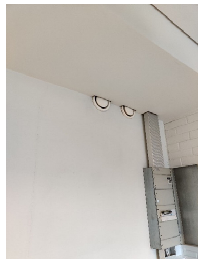
Kuva 6.17. Tilassa 1110 poistokanavat olivat osittain peitossa. Tilassa oli poikkeava haju.
