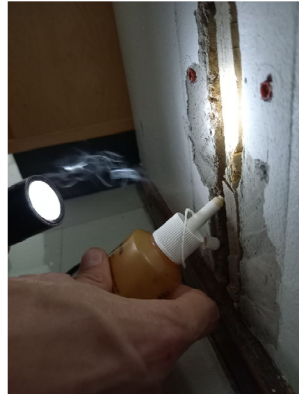
Kuva 5.6. Liikuntasauaman takaa on merkittäviä ilmavuotoja sisäilmaan, joka havaitaan merkkisavulla. Kuva tilasta 4123.
