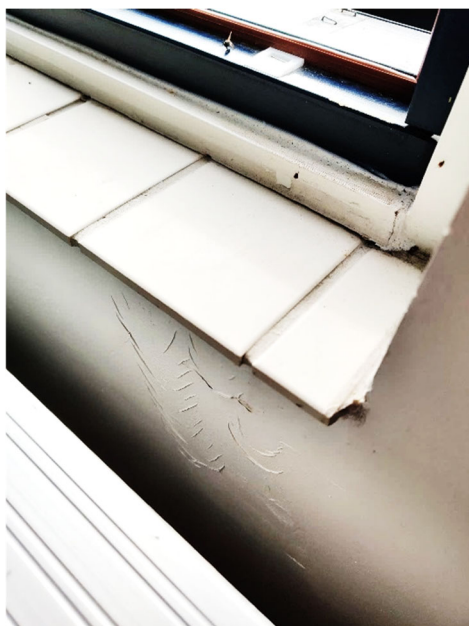
Kuva 5.3. Valumajälkiä ikkunan alla tilassa 4117
