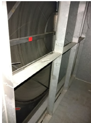
Kuva 6.2. TK101 lämmöntalteenottokeho. Kuvassa näkyy teippinäyte KK7, jossa ei todettu poikkeavia määriä mineraalikuituja
