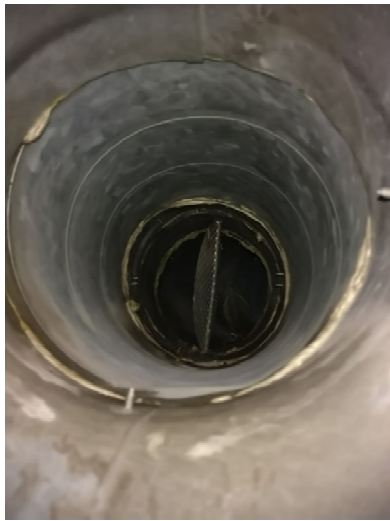
Kuva 5.3. Vanhoissa tuloilmakanavissa on paikoin pinttynyttä likaa.
