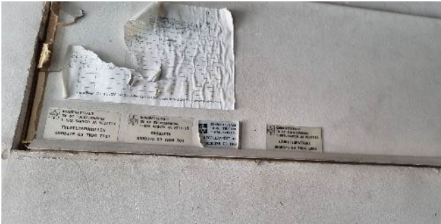
Kuva 143. Tuloilmakone TK4 sijaitsee keittiön katossa. Suodattimet on kirjausten perusteella vaihdettu vuosittain.
