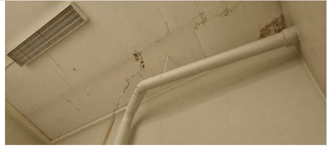
Kuva 52. Vanhoja kosteuden aiheuttamia jälkiä käytävän 224 katossa entisen ulkoseinälinjan kohdalla
