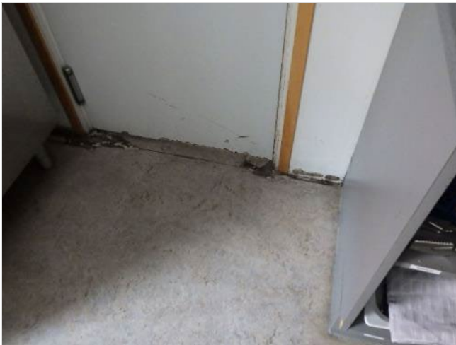
Kuva 90. Keittiön 122 ja tarjoilutilan 124 väliseinässä ja ovesa havaittiin kosteusvaurio.
