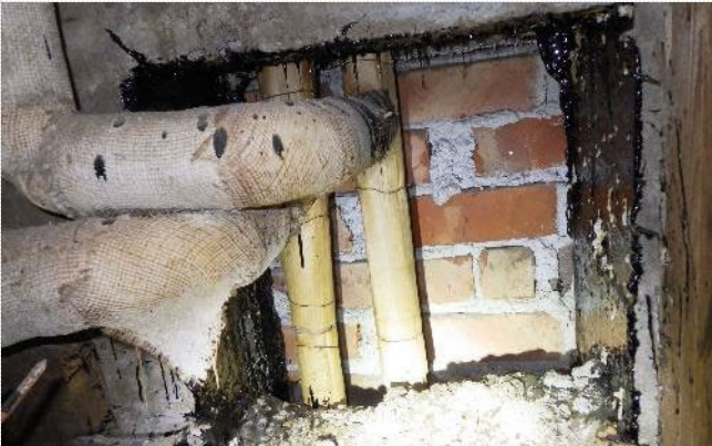
Kuva 39. Asbestieristeiset putket jatkuvat osin seinäraken- teiden sisällä oleviin pystykuiluihin.
