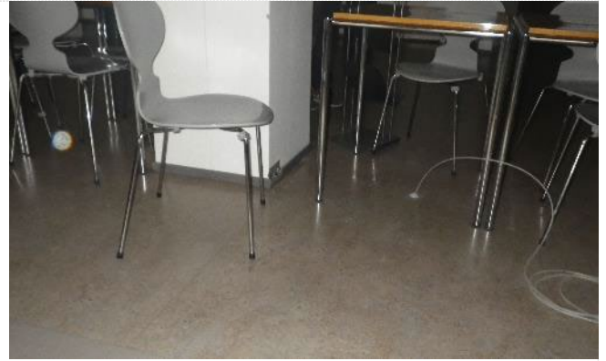
Kuva 59. Merkkiainetutkimuksessa alapohjan alalaattapalkiston onkalosta ei havaittu ilmapuotoja tilojen normaalissa käyttöpaineessa.
