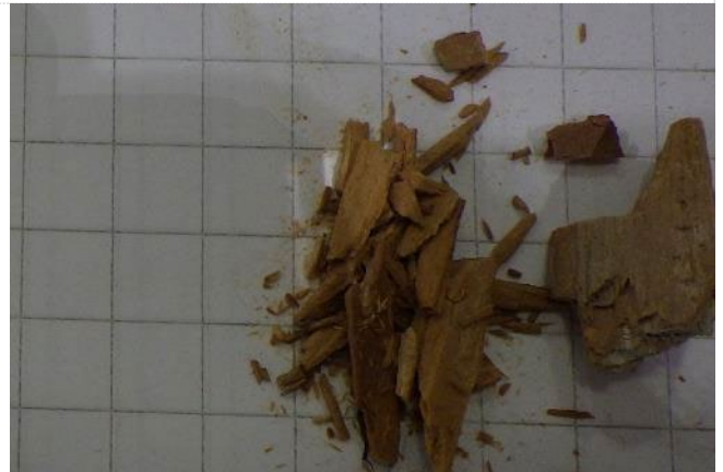
Kuva 65. Alapohjan kevytbetonirakenteen alla olleessa ilmatilassa havaittiin lahoa puuta.
