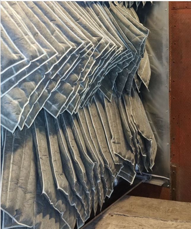
Kuva 132. Poistoilmakoneen puhallinkammio on pinnoitettu ainoastaan reikäpellillä suojatulla mineraalivillalla, poistoilma tulee kammioon kuvan suodattimien läpi.
