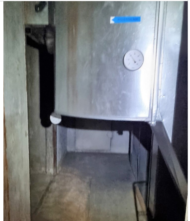
Kuva 133. Raitisilma johdetaan vasemmalla olevaan kostutinkammioon lattia-rajasta, palautusilma sen päältä peltikanavasta.
