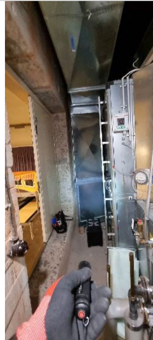
Kuva 121. Keilahallin (TK5/PK5) IV-konehuone.
