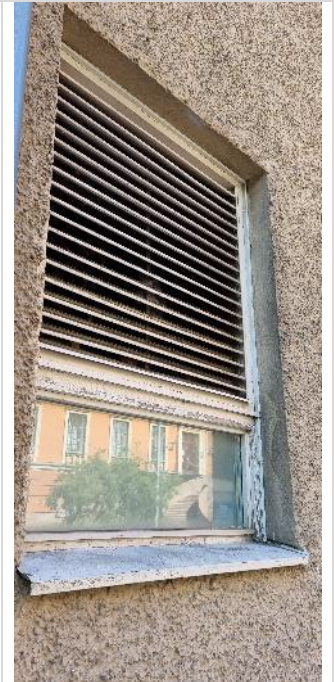
Kuva 122. Keittiön TK4-koneen raitisilmasäleikkö.
