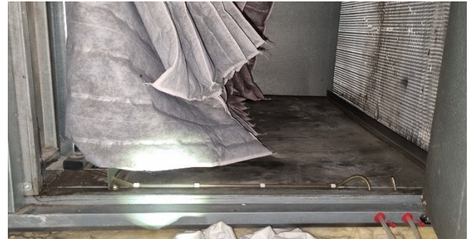
Kuva 144. Suodatinkammio on melko likainen, suodattimien painumista kammion pohjalle ei ole estetty.
