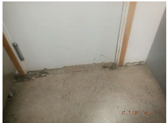
Kuva 50. Keittiön 122 ja tarjoilutilan 124 oven ympäristössä havaittiin pintakartoituksessa kosteuspoikkeamaa.
