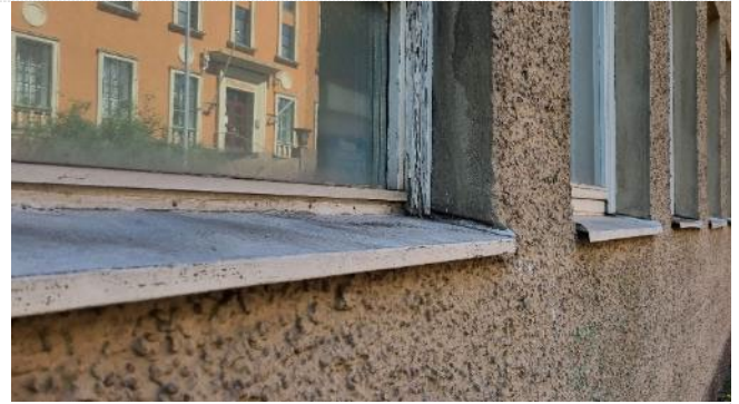
Kuva 17. Rakennuksen alkuperäiset ikkunat ovat kunnostuksen tarpeessa. Vesipellit on kallistettu ja reunat on upotettu seinärakenteen sisään.
