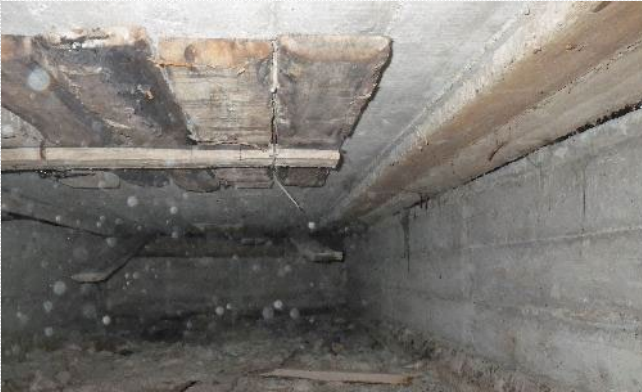
Kuva 72. Välipohjan ontelon muottilaudoitusta on purettu pintalaatan aukon kautta. Tilaan on kuitenkin jätetty runsaasti puuainesta.
