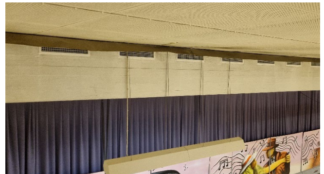
Kuva 142. Tuloilma jaetaan katon rajassa olevasta rakennusaineisesta kanavasta, jota ei kyetty tarkastamaan.
