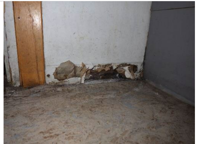
Kuva 91. Seinän kipsilevyn kastuminen on johtanut materiaalinäytteen M3 perusteella myös mikrobivaurioon.
