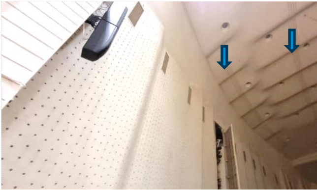
Kuva 10. Konserttisalon tuloilma jaetaan katosta (sininen nuoli). Kattoon ja seiniin on tehty akustiikan vuoksi 22 000 reikää.
