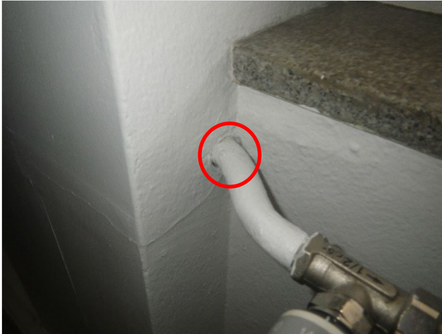
Kuva 88. Patteriputkien läpivienneistä havaittiin merkittävää ilmavuotoa...
