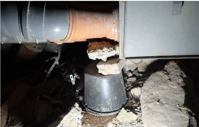
Kuva 31. Alkuperäisiä putkikannatuksia on korvattu mm. muoviämpäreillä ja sähkökiskoilla.
