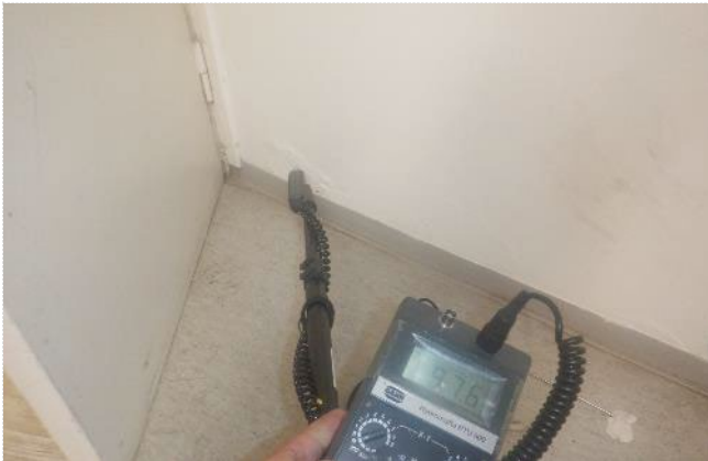
Kuva 47. Keilahallin lounaan puoleisessa sulkutilaan rajoituvassa seinässä havaittiin kupruilua ja poikkeavia kosteuskokemuksia pintakosteuskartoituksessa.
