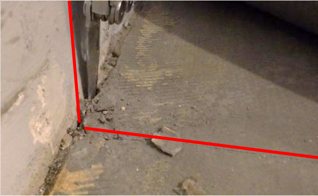
Kuva 58. Pintalaatta on kahvion 125 ulkoseinustalla irti ulkoseinärakenteesta, joten kanaalien kohdalla oleva lämmöneriste on suorassa ilmayhteydessä sisäilmaan. Rakenteessa kulkeva liikuntasauama merkitty punaisella viivalla.
