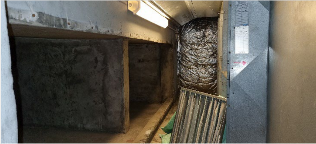
Kuva 130. TK2:n raitisilmakanavat vasemmalla ja suodattimet oikealla.
