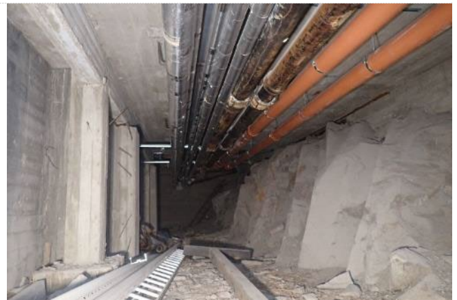
Kuva 26. TAI:n vastaisen seinän vieressä studion alapohjarakenteena on alalaattapalkisto, joka muuttuu oikealla näkyvän muurin kohdalla maanvaraiseksi laataksi.
