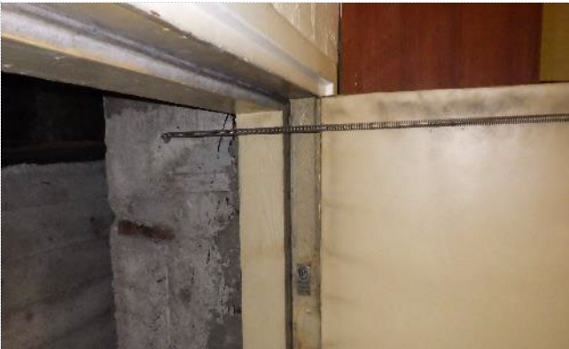
Kuva 45. Keilahallin katsomon edessä oleva luukku johtaa sulkutilaan, jonka pohjalla kulkee hallin rakennusaineinen poistoilmakanava.
