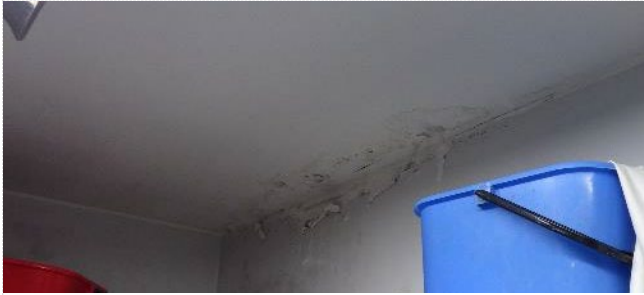
Kuva 51. Vanha kosteusvaurio siivouskomerossa 130.
