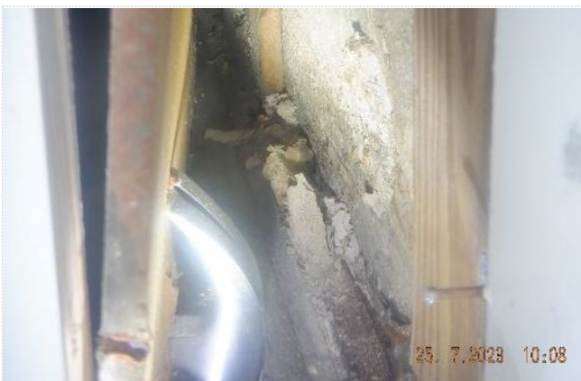
Kuva 78. Tilassa K7 betonimuurissa kiinni oleva puurunko on kosteusvaurioitunut, sisäpinnan puukuitulevyssä todettiin aktiivista mikrobikasvua (M1).
