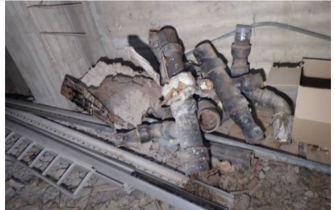
Kuva 30. Vanhaa putkijätettä sulkutilassa.
