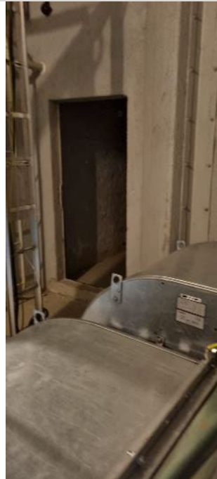
Kuva 120. TK2 tuloilmakam-mio ja puhaltimet.
