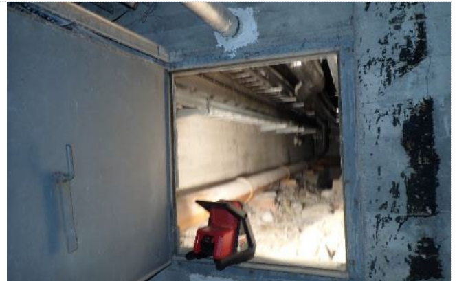
Kuva 32. Sulkutilassa havaittiin auki jätetty luukku TAI-rakennuksen alla kulkevaan kanaaliin, josta virtasi voimakkaasti ilmaa sulkutilaan.
