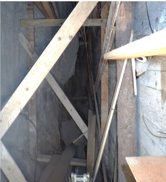
Kuva 35. Käytävän K17 vieressä kallioulouhos ulottuu lähes kiinni seinärakenteisiin.
