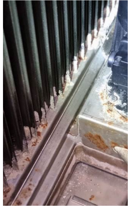
Kuva 140. Koneen pohjalla oli paikoin merkkejä kosteudesta.
