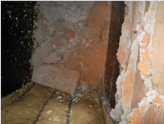
Kuva 93. Seinän ilmatilassa havaittiin mineraalivilla seinäkerkeitä,...
