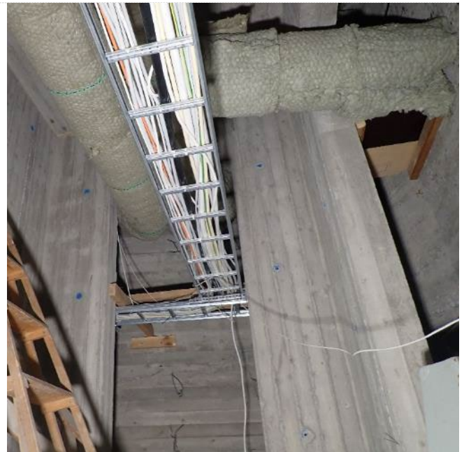
Kuva 22. Jälkikäteen asennetun hissien perustukset (vasemmalla) katkaisevat alkuperäisen tekniikkakanaalin, minkä vuoksi ilmanvaihtokanavat kiertävät perustukset sulkutilassa.
