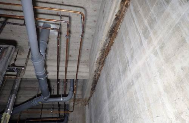
Kuva 29. TAI:n vastaisessa seinässä palkin alla oleva erotuskaistana toimiva puukuitulevy on pahoin vaurioitunut.
