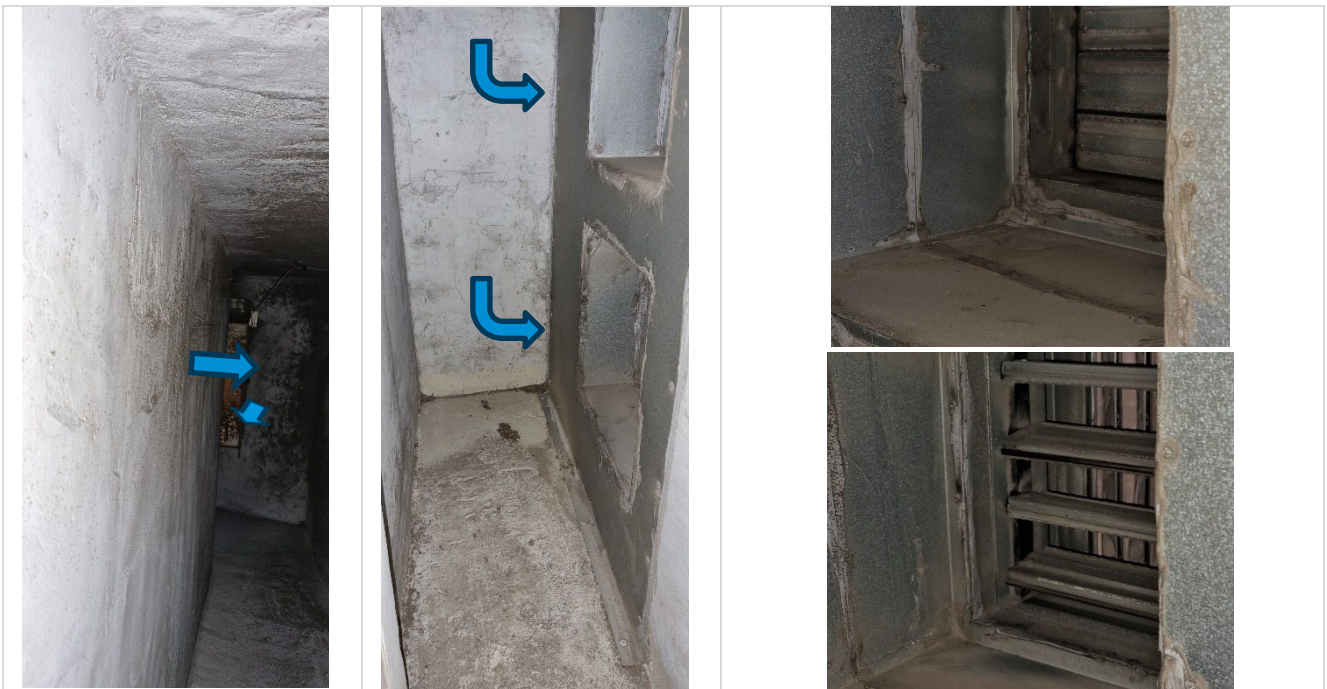
Kuva 125. Raitisilma johdetaan K17 katossa kulkevasta kanavasta alas koneille TK1 (alla) ja TK3 (päällä).
