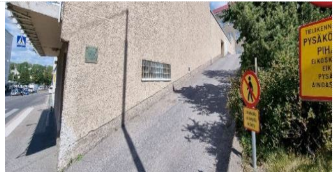
Kuva 13. Keilahallin sisäänkäynnin päällä on huonokuntoinen parveke. Kaakon puolella jyrkästi nouseva, asfalttipäällysteinen ajoramppi ulottuu kiinni sokkeliin.
