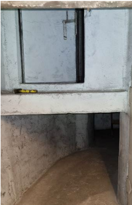
Kuva 138. Keilahallin tuloilmakoneen TK5 raitisilmakanava alla. Yläpuolella olevan luukun takana tuloilmakanava.
