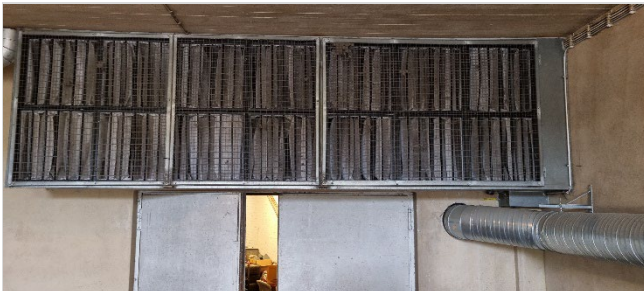
Kuva 117. Raitisilmasäleikkö huoltokatoksessa käytävän K17 päässä ulko-ovien päällä.
