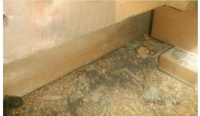
Kuva 55. Puurunkoisen keilaradan alla alapohjan päällystämättömän pintalaatan päällä purua, lastuja ja roskia.
