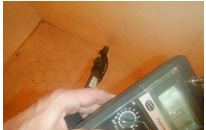
Kuva 48. Kosteuspoikkeamaa seinän alaosassa keilahallin pesutiloissa.
