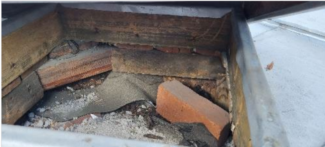
Kuva 101. Yläpohjatila on paikoin matala eikä mahdollista tilan tarkastamista ilman vesikatteen avaamista.
