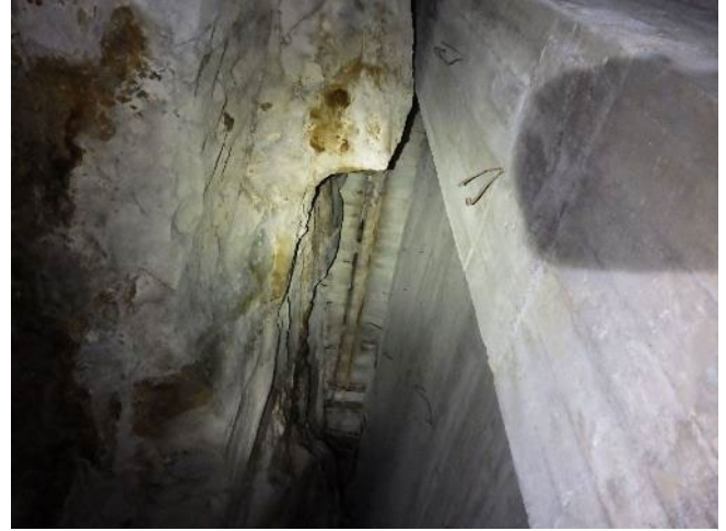
Kuva 44. Sulkutila ulottuu lipunmyyntilojen alapohjarakenteeseen, laatan teräkset osin näkyvissä ja ruostuneet.
