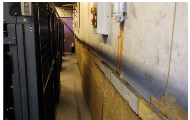
Kuva 79. Keilahallin takaseinässä betonimuurin sisäpinnalla on iäkäs akustointi, joka toimii mineraalikuitujen lähteenä.
