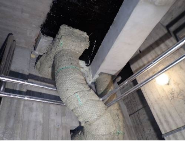
Kuva 23. Vanha putkikanaali jatkuu hissien perustusten TAI:n puolella. Katossa vanha pikisively.
