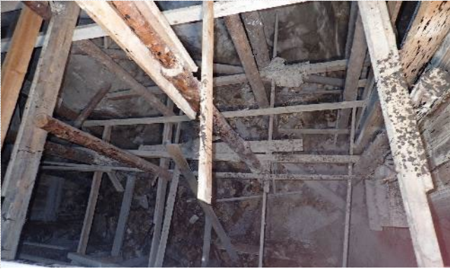
Kuva 37. Sulkutilaan on jätetty paljon puurakenteita.
