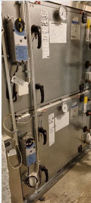
Kuva 119. Tuloilmakoneet TK1 ja TK3.
