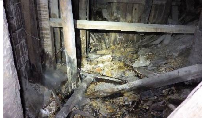
Kuva 38. Tilan pohja on paikoin märkä ja muottilaudoituk- sissa sekä muissa puurakenteissa on laajoja lahovaurioita.
