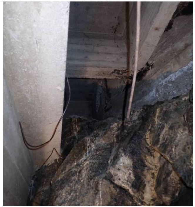
Kuva 36. Keilahallin lounaisreunalla kallio ulottuu paikoin kiinni seinärakenteisiin.
