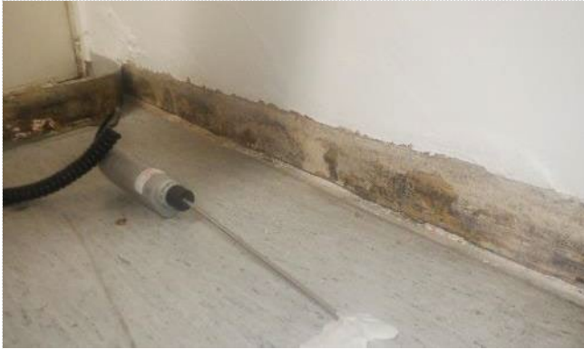
Kuva 54. Tilan K7 viiltomittauksessa V1 liimatilan kosteus todettiin poikkeavaksi.
