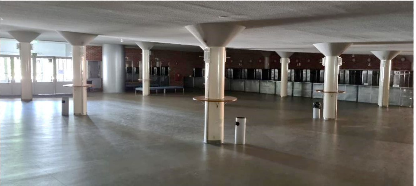
Kuva 8. Eteishallin lattia mukalee maanpinnan muotoilua (viittää pohjoiseen). Yläpuolella olevaa konserttisalia kannattelee 20 sienimäistä pilaria. Kattoon on tehty äänen- ja lämmöneristykseksi asbestiruiskutus.
