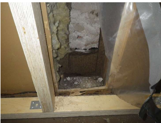
Kuva 15. Tilimuurauksen alaosassa laasti on tukkinut tuuletusraon (RA.08).
