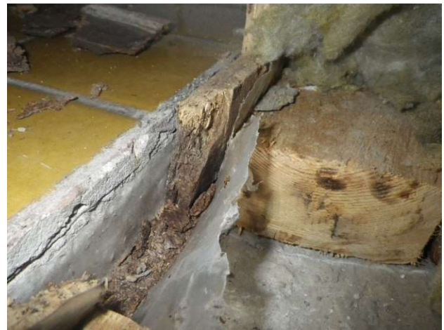
Kuva 14. Seinälevyn alaosa on lahovaurioitunut. (RA.07).
