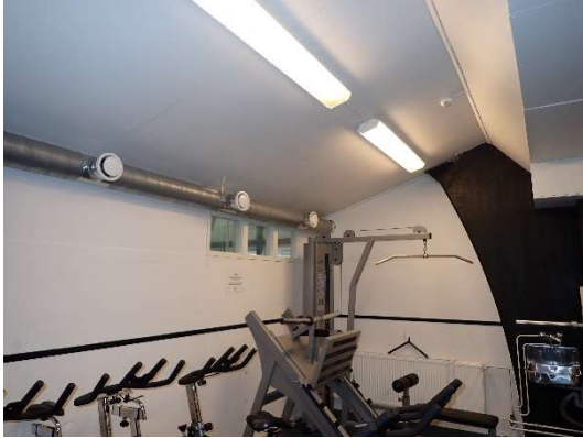
Kuva 200. Kaukaloiden väliin rakennetun kuntosalitilan poistoilmapäätelaitteet.
