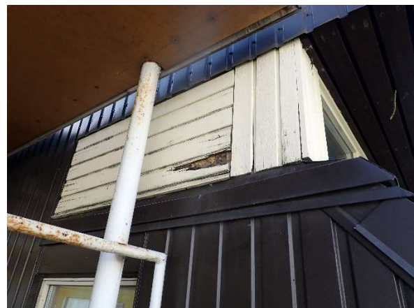
Kuva 55. Vesi valuu katoksen reunan yli jäähallin ulkoseinään. Puu-ulkooverhous on lahonnut.
