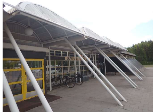
Kuva 45. Sisäänkäynnin edustalla on teräsrakenteista lasiseinää ja teräsrakenteiset ovet. Sisäänkäynnin edustalla on katos, mutta katos on irti ulkoseinälinjasta ja mahdollistaa sateen ja lumen pääsyn ulkoseinälle.
