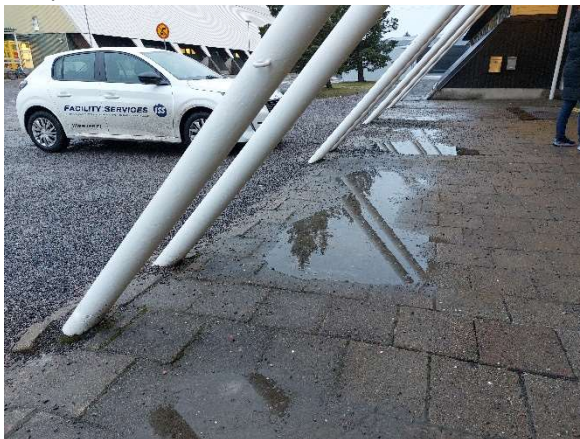
Kuva 181. Kiveyksessä on painauma. Vesi kertyy sisäänkäynnin edustalle.
