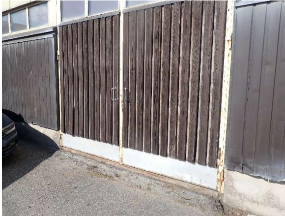
Kuva 50. Teräsrakenteisten ulko-ovien puuverhous on huonokuntoinen.
