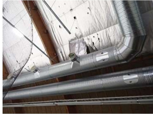
Kuva 189. Jäähallin tuloilmakanavat ja -pätelaitteet.
