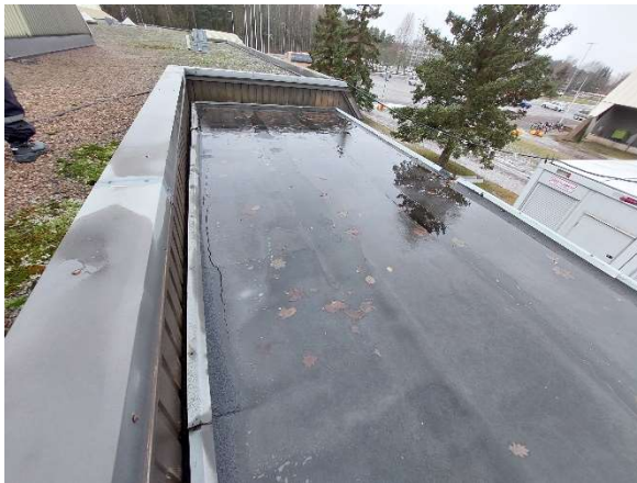
Kuva 146. Luoteisnurkassa olevan katoksen päälle kertyy vettä.
