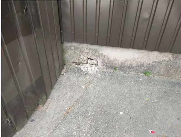
Kuva 56. Sokkeliin on kohdistunut voimakasta kosteusrasitusta. Betonissa on merkittävä vaurio sokkelin ulkokuoressa.
