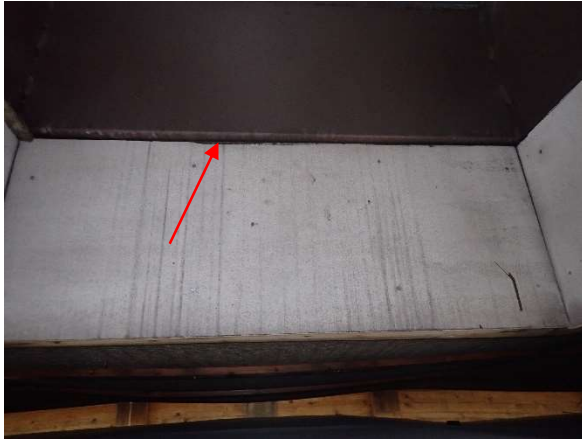
Kuva 169. Savunpoistoluukun sisäpinnossa on valumajälkiä. Luukun teräsosan ja kuitusementtilevyverhotun ylösnostorakenteen välissä on paikoin avoin ilmarako.
