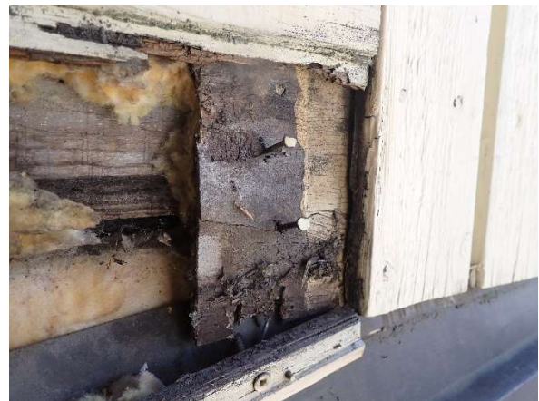
Kuva 82. Ulkoverhouksen alla olleet vanerilaput olivat myös lahonneet, joka viittaa pitkäaikaiseen ja voimakkaaseen kosteusrasitukseen.
