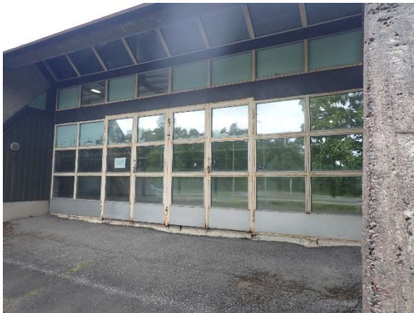
Kuva 46. Teräsrakenteisissa ovissa on korroosiovaurioita. Maanpinta kallistaa voimakkaasti rakennuksesta pois päin. Asfaltin pinta on hyvin epätasainen.
