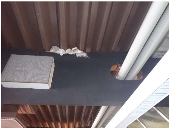
Kuva 140. Katto on vuotanut kahvion kohdalla. Vuoto on tukittu väliaikaisesti rätiltä.
