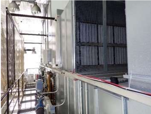
Kuva 188. Osa jäähallin ilmanvaihdon tuloilmasta otetaan kiertoilmana.
