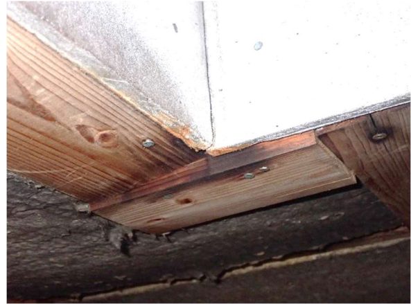
Kuva 121. Vesi on vuotanut savunpoistoluukun nurkan kohdalla.
