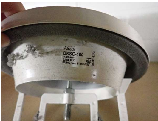
Kuva 196. Poistoilmapäätelaitteeksi on iv-piirustuksissa merkitty URH-160, vaikka päätelaite on DKSO-10. Tuotteilla on eri k-arvot, jotka tulee säätää tehdessä huomioida.
