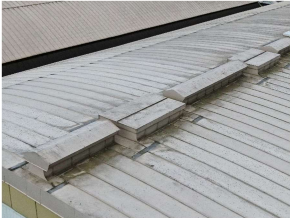
Kuva 128. Vesikaton keskilinja on melko tasainen, jolloin veden poistuminen hidastuu. Läpivientien kohdille on kertynyt epäpuhtauksia.
