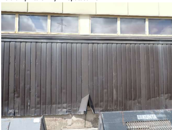
Kuva 48. Laajoja vaurioita päädyn profilipellityksessä. Avoin pellitys mahdollistaa rakenteiden kastumisen.
