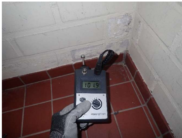
Kuva 99. Seinässä havaittiin kosteuspoikkeama-alue. Kuva varaston puolelta.
