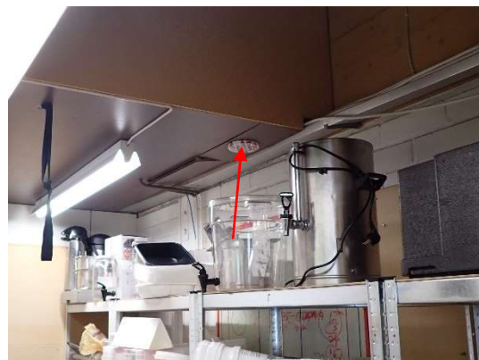
Kuva 199. Keittiön poistoilmapäätelaite on teipattu umpeen. Kattolevy on osittain irronnut ja mahdollistaa epäpuhtauksien tulon ko. tilaan.
