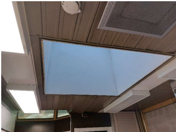
Kuva 142. Käyttäjiltä saadun tiedon perusteella katto on vuotanut keittiön kattoikkunan kohdalla.
