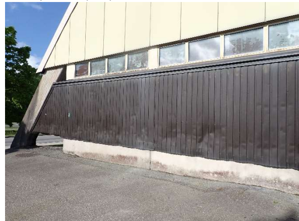
Kuva 47. Rakennuksen päädyn profilipelti on huonokuntoinen. Pellityksessä on laajalti törmäykseen viittaavia jälkiä.
