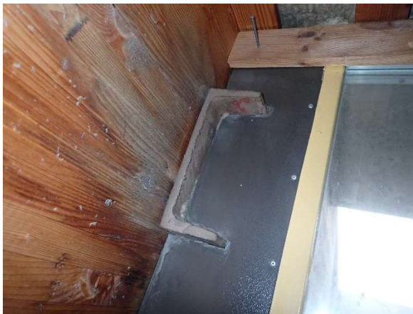
Kuva 172. Rakenneavauskohdan vieressä on liimapuupalkin läpivienti ulkoseinästä. Liittymä on epätiivis.
