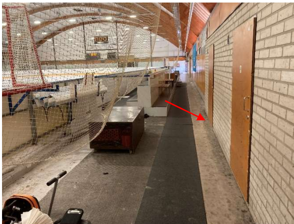
Kuva 39. Käytävän alapohjassa väliseinän edessä oli laajalti tummentumaa.
