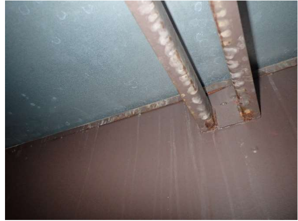
Kuva 170. Savunpoistoluukun teräsrakenteissa on kosteuden aiheuttamia jälkiä ja korroosiota.
