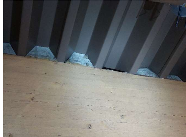
Kuva 88. Liimapuupalkkien ja sisäkaton välissä on avoimia mineraalivillakuitupintoja. Osa villoista oli rikki ja ne pölsivät ilmavirtausten mukana.
