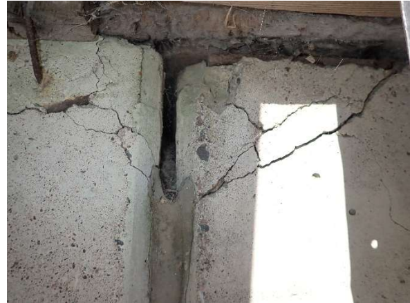
Kuva 57. Elementtirakenteisen sokkelin elastinen saumassa ei jatku ylös asti. Sokkelin kulmat ovat murtuneet.
