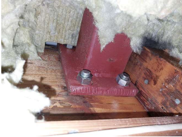
Kuva 161. Tuuliristikon liitoksen ympäristössä on kosteuden aiheuttamia jälkiä. YP4.
