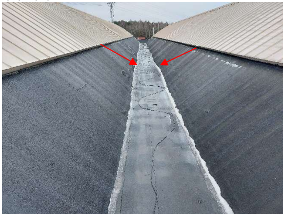
Kuva 130. Kourun pohjalla on sulanapitokaapeli, joka on asemoitu lähelle kattokaivoja.
