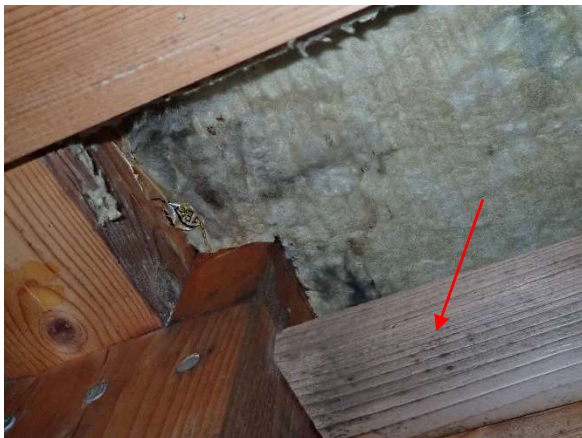
Kuva 159. Villassa on ilmavuotoon viittaavia tummentumia ja kosteuden aiheuttamia jälkiä. Laudassa (nuoli) on todennäköisesti mikrobikasvun aiheuttamia tummentumia. YP2.
