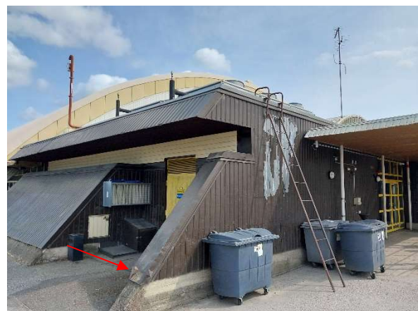
Kuva 49. Profiilipellin pinnoite on huonokuntoinen. Hattupellissä on vaurioita (nuoli).
