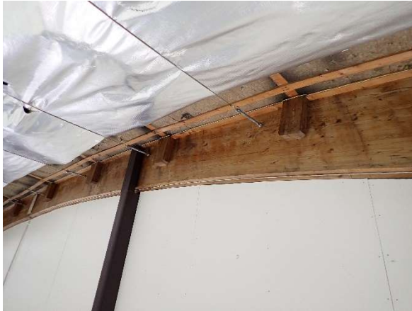
Kuva 120. Liimapuukaaripalkissa on voimakkaita kosteuden aiheuttamia jälkiä.
