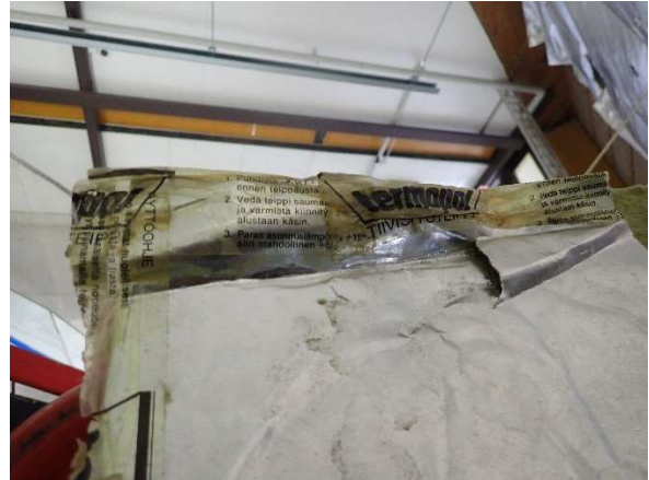
Kuva 156. Mineraalivillan alumiinipinnassa on kosteuden aiheuttamia jälkiä. Alumiinipinnaiset villat on teipattu neljältä sivulta. Teippauksessa ei havaittu avoimia saumoja. YP1.
