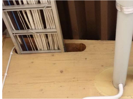
Kuva 195. Sähköhyllyn läpivienti mahdollistaa ilmavirtojen siirtymisen.
