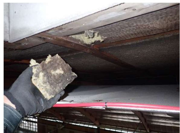
Kuva 168. Yläpohjan mineraalivilla on erittäin likaista.
