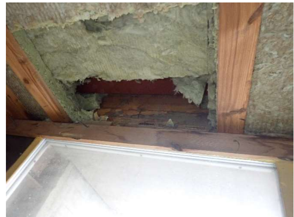
Kuva 173. Rakenneavaus on ikkunan yläpuolella. Ikkunan päällä ja rakenneavauksen sisällä on veden lammikoitumiseen viittaavia jälkiä.
