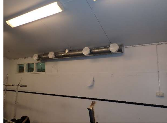
Kuva 201. Kuntosalin tuloilma on johdettu 2 kentän tuloilmakanavasta.
