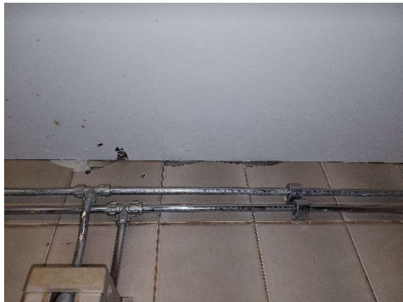
Kuva 97. Märkätilojen laatoitus on vaurioitunut yläosastaan.
