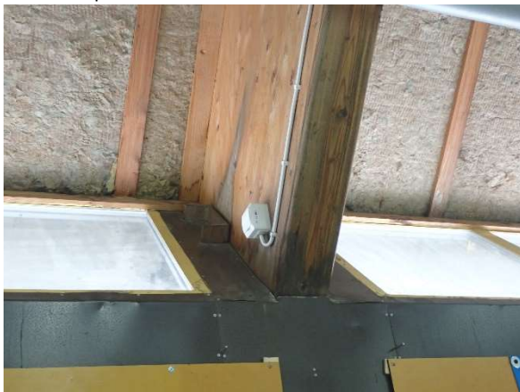
Kuva 60. Kosteus on kondensoitunut kylmän ja lämpimän pinnan liittymään aiheuttaen näkyviä kosteusjälkiä. Lisäksi rakenteessa on ilmavuotoa.
