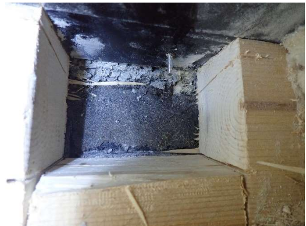
Kuva 103. Alajuoksun alla on bitumikermikaista.
