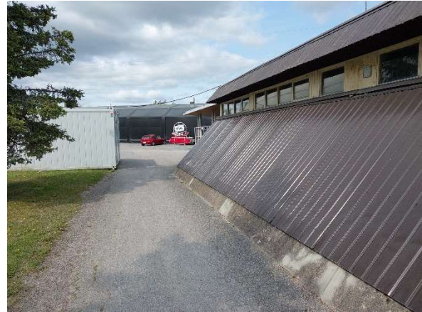
Kuva 51. Vesi valuu profiilipellin päältä ulkoseinän alaosaan. Alaosien käsittelemättömälle betonipinnalle kohdistuu voimakasta kosteusrasitusta.
