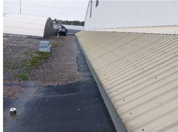
Kuva 139. Sosiaalitalojen vesikaton päällä on laajoja alueita, joissa ei ole singeliä. Singelin päällä on sammaloitumista, joka viittaa veden seisomiseen katteen päällä.
