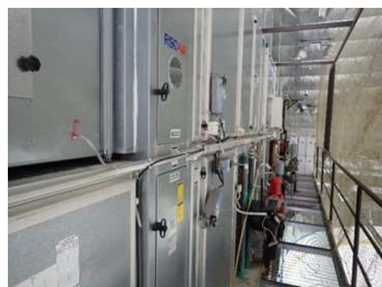
Kuva 187. Jäähallin kenttien ilmanvaihtokone.
