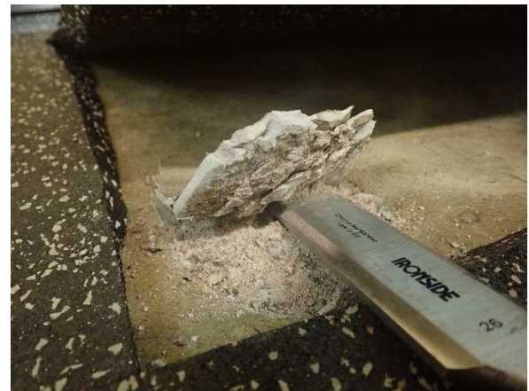
Kuva 35. Märkätilan edessä on kosteuspoikkeama-alue. Tasoite on aistinvaraisesti arvioituna märkää ja hajosi käsiteltäessä.
