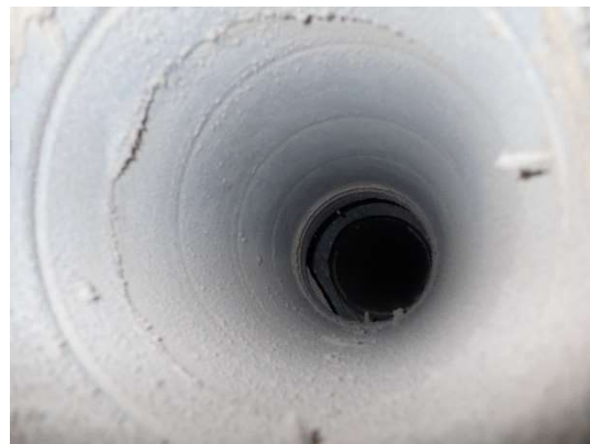
Kuva 197. Poistoilmanvaihtokanavat olivat osittain likaiset.
