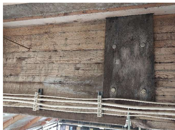
Kuva 113. Vanerikiinnikkeet ovat tummuneet. Osa kiinnikkeistä on uusittu.
