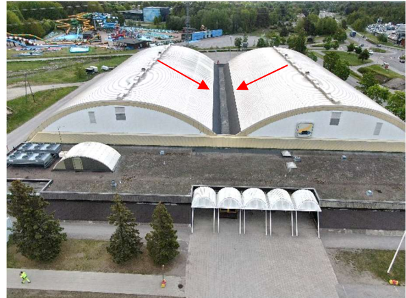
Kuva 129. Hallien väliselle kumibitumikermillä päällystetylle osuudelle kertyy runsaasti lunta ja vettä.
