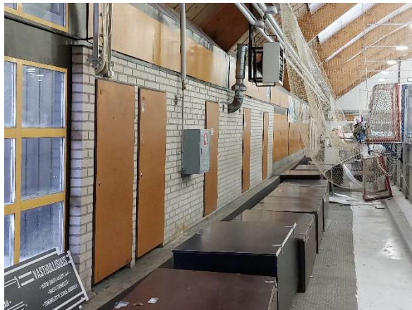
Kuva 95. Jäähallien ulkoseiniä vasten olevissa varastotiloissa on kalkkihiiekkatiiliseinät ja puiset laakaovet. Tilat ovat käyttäjiltä saadun lähtötiedon perusteella käyttökielossa.
