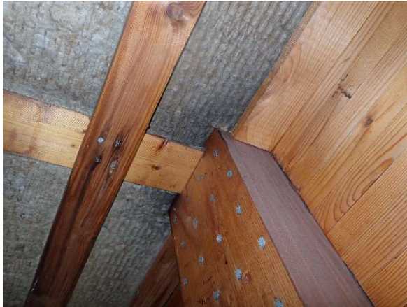
Kuva 155. Rakenneavauskohdassa YP1 on ilmavuotoon viittaava tummentuma. Villoja kannattelevassa laudassa on kosteuden aiheuttamia jälkiä.
