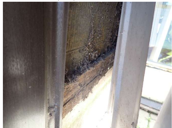
Kuva 71. Koolauslaudassa on lahovaurioita ja villan ulkopinnassa on runsaasti epäpuhtauksia. US4.
