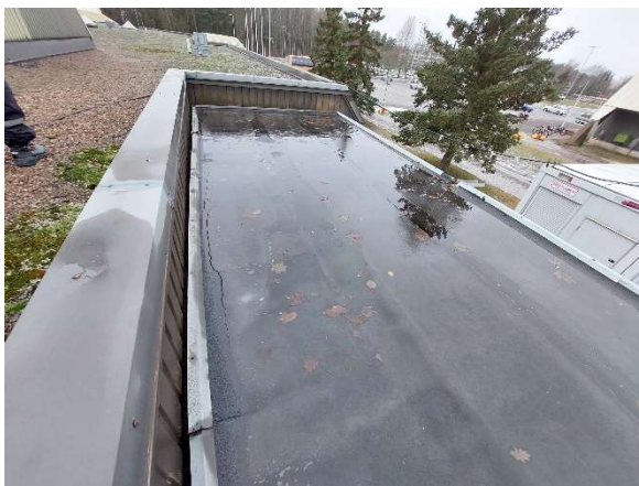
Kuva 54. Luoteisnurkassa olevan katoksen päälle kertyy vettä.
