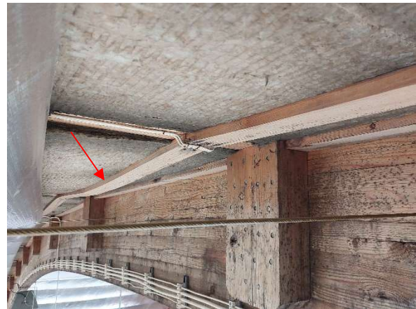
Kuva 123. Yläpohjan villojen kannatinlaudat ovat voimakkaasti kaareutuneet kaikissa tarkastetuissa kohdissa.
