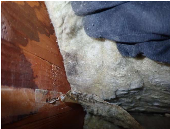
Kuva 157. Liimapuupalkissa on kosteuden aiheuttamia jälkiä. YP1.
