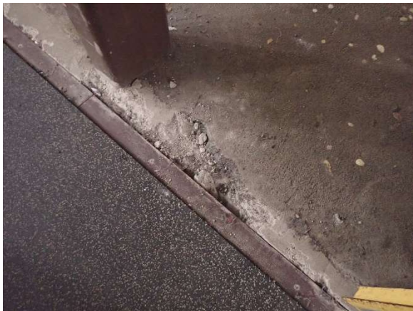
Kuva 10. Vaurioita alapohjan betonilaatassa halliosuudella.
