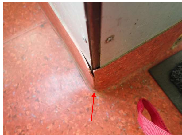
Kuva 17. Muovimaton seinälle nosto on revennyt ja alanurkassa on reikä (nuoli).
