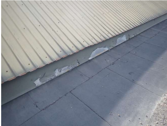
Kuva 138. Pellin pinnoite on kulunut sääräsituksessa jäähallin ja sosiaalitalan liittymässä.
