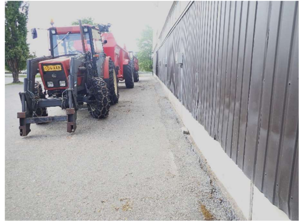
Kuva 184. Maanpinta kallistaa pois päin rakennuksesta.
