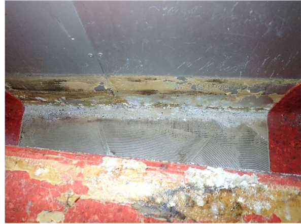
Kuva 41. Viiltomittauskohta VM3. Kuvan taustalla ulkoseinä kahvion kohdalla. Rakenteessa oli aistinvaraisesti arvioituna mikrobivaurioita.
