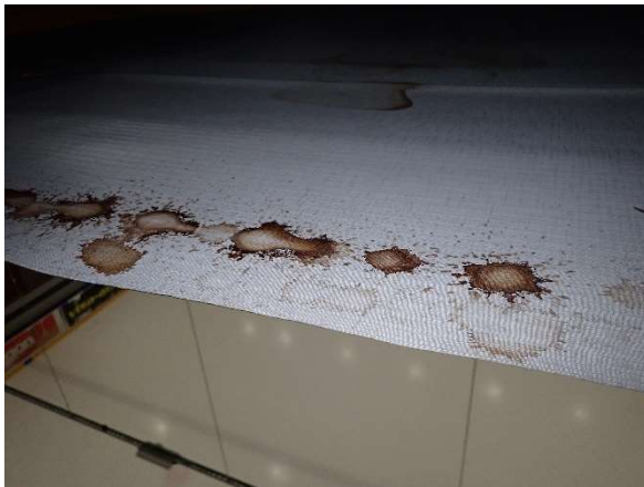
Kuva 122. Todennäköisesti kattovuodon aiheuttamia jälkiä jäähallin alumiinipinnoitetun kankaan yläpuolella. Kuva savunpoistoluukun läheisyydestä.
