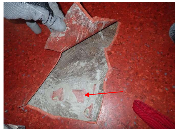
Kuva 30. Tasoitteen alla on vanha muovimatto.
