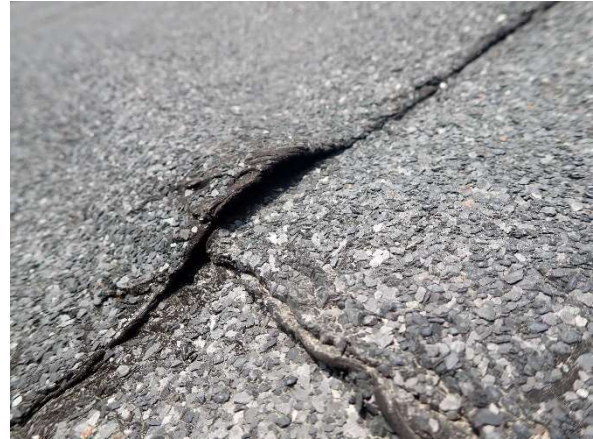
Kuva 133. Kumibitumikermin saumat ovat paikoin huonokuntoiset.
