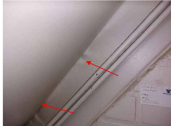
Kuva 63. Varaston sisäverhouksena on käytetty kuitusementtilevyä. Ulko- ja väliseinän liittymässä on ilmavuotoon viittaavaa tummentumaa. Vastaavia ilmavuotoja oli useammassa varastokopissa.
