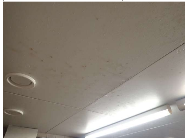
Kuva 141. Märkätilan katossa on laajalti tummia jälkiä.
