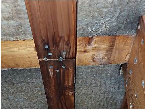
Kuva 114. Kannatinlautojen liitoksissa on jälkiä voimakkaasta kosteusrasituksesta.
