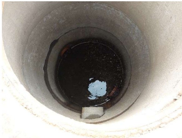
Kuva 185. Tarkastuskaivossa vedenpinta on viemäri­linjan alapuolella.
