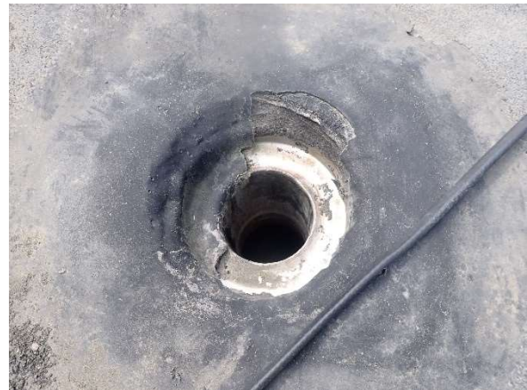
Kuva 131. Kattokaivojen vedeneriste on vaurioitunut ja todennäköisesti vuotaa.
