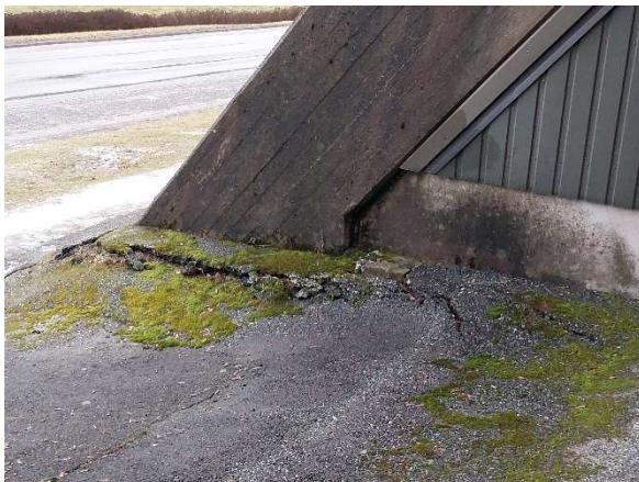
Kuva 58. Liimapuukehien perusrakenteisiin sekä sokkeliin kohdistunutta voimakasta kosteusrasitusta. Sokkeli on voimakkaasti tummunut, asfaltin päällä kasvaa sammalta ja asfaltti on pahoin vaurioitunut.
