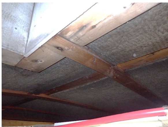
Kuva 167. Savunpoistoluukun ympäristössä on laajalti kos- teuden aiheuttamia värimuutoksia ja viitteitä ilmavuo- doista.
