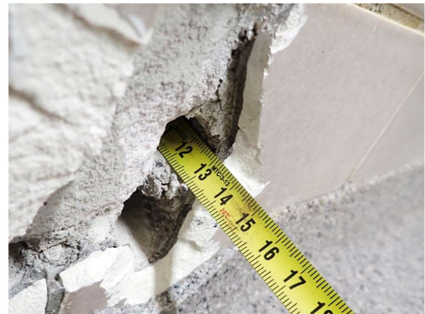
Kuva 100. Laatoituksen alla ei ole vedeneristettä.
