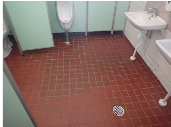
Kuva 23. Yleisissä WC-tiloissa on keraaminen laatta.
