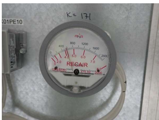
Kuva 186. Tutkimus hetkellä jäähallin ilmanvaihtokoneiden, TK2 ja TK3, ilmamäärät olivat n. ±4000 l/s.
