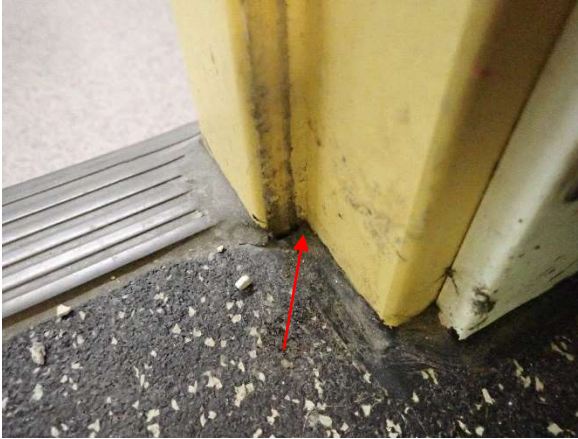
Kuva 36. Normaalissa ilmanvaihdon käyttöolosuhteessa karmin liittymässä oli pientä vuotoa.
