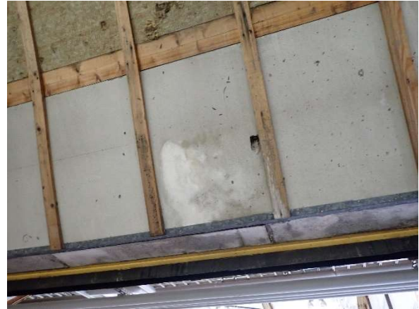
Kuva 115. Levyn pinnassa on kosteusvaurioon viittaava värimuutos hallin keskiosassa.
