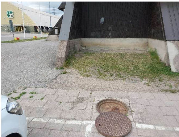
Kuva 179. Rakennuksen ympärillä on yksittäisiä tarkastuskaivoja, mutta kaikkien avaaminen ei ollut mahdollista normaaleilla kaivon avaamiseen tarkoitetuilla käsityökaluilla.
