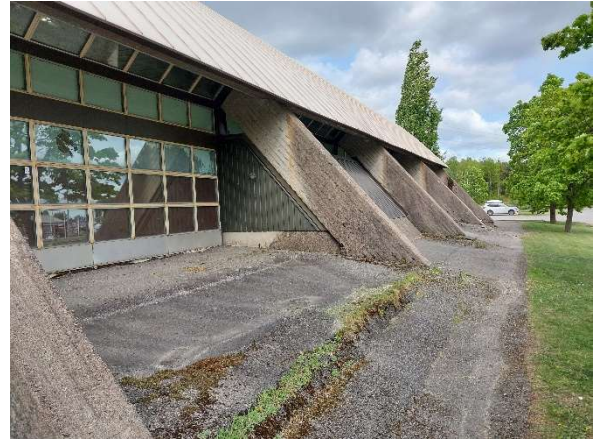
Kuva 178. Asfaltissa on laajoja vaurioita. Asfaltin läpi kasvaa kasvillisuutta ja rakennuksen perustusrakenteet ovat voimakkaan kosteusrasituksen alaisia.
