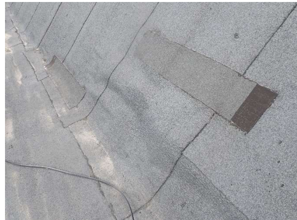
Kuva 135. Kumibitumikermissä on vesivuotoihin viittaavia ilmapusseja.
