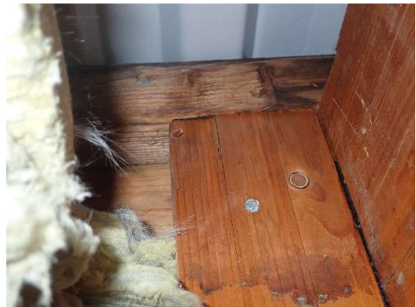
Kuva 160. Puurakenteissa on kosteuden aiheuttamia jälkiä. YP2.
