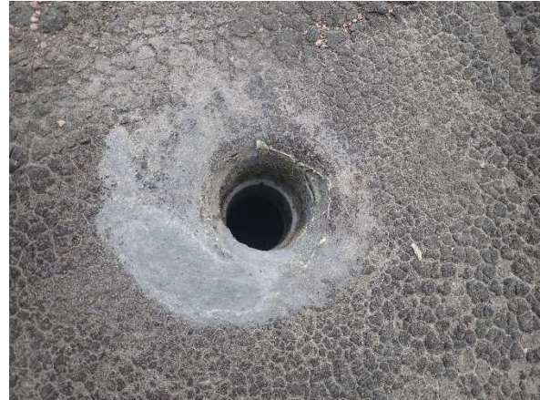
Kuva 145. Vedeneristeessä on repeämiä kattokaivon ympärillä.
