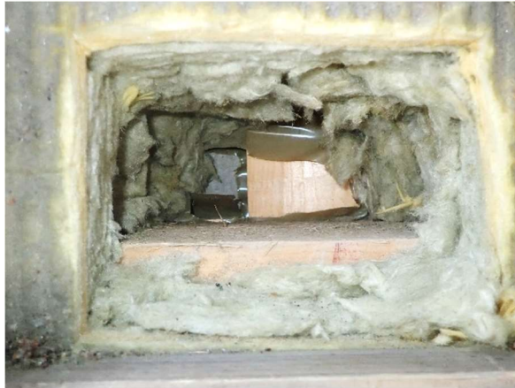
Kuva 65. Rakenneavaus US1, pellitetty kalteva ulkoseinä. Rakenteessa on kaksi höyrynsulkumuovia.
