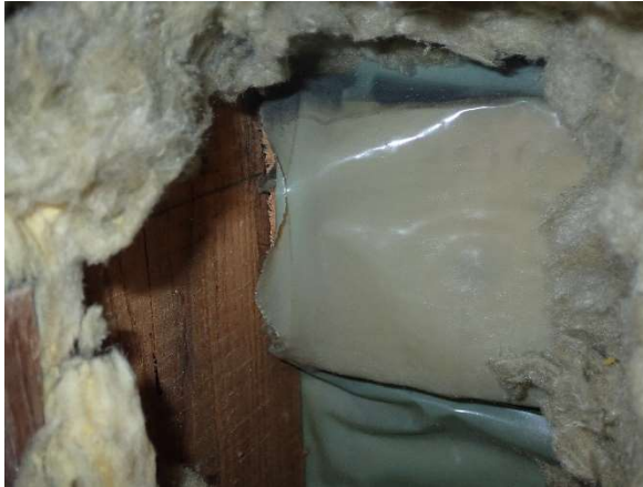
Kuva 83. Höyrinsulkumuovi on epätiivis.
