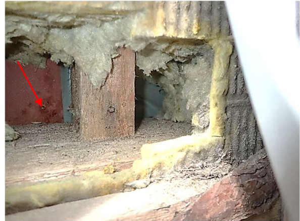
Kuva 69. Rakenneavauksessa US2 höyrynsulkumuovi katkeaa teräspilarin kohdalla. Pilarissa on havaittavissa piste-mäistä korroosiota (nuoli).
