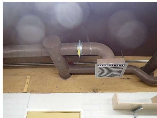
Kuva 193. Joidenkin IRIS-säätöpeltien suojaetäisyydet eivät vastaa laitetoimittajan ohjeistusta.
