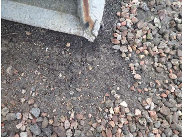
Kuva 144. Kumibitumikermi on aistinvaraisesti arvioituna iäkäs ja kermissä on pieniä halkeamia.
