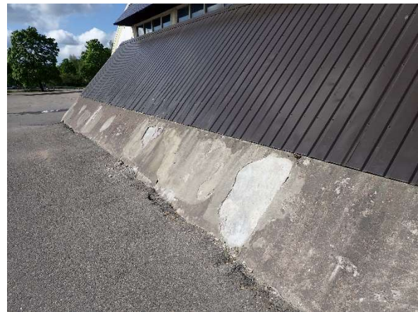
Kuva 53. Betonirakennetta on todennäköisesti korjattu ylitasoittamalla rakenteita paikallisesti. Tasoitekerrokset ovat irti.
