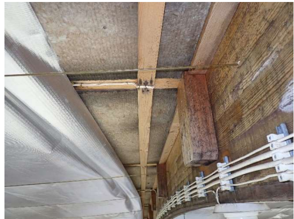
Kuva 158. Villassa on ilmavuotoon viittaavia tummentumia. Liimapuupalkissa ja klossiliitoksessa on todennäköisesti mikrobikasvun aiheuttamia tummentumia. YP2.
