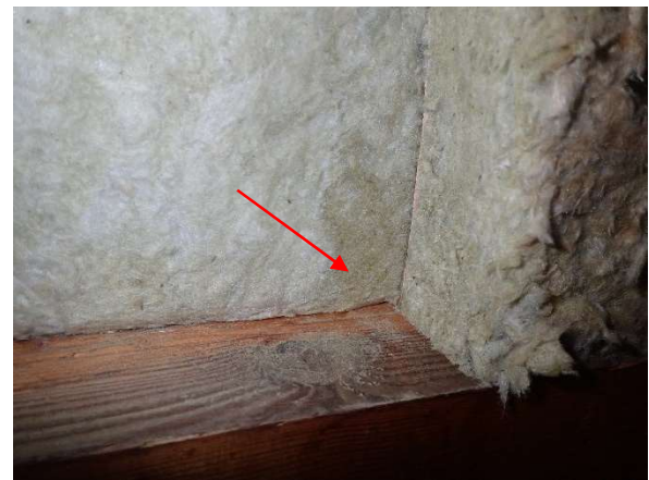
Kuva 164. Villassa on kosteuden aiheuttamia jälkiä.
