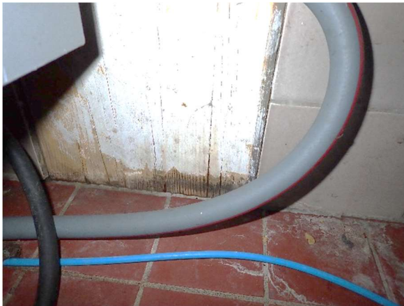
Kuva 26. Astianpesukoneen takana on epäpuhtauksia ja kosteus on vaurioittanut puurakenteen alaosa.
