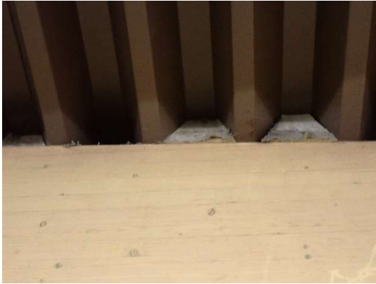
Kuva 194. Väliseinien yläosat olivat avonaiset ja osittain pinnoittamilla eristeillä tukittuja.
