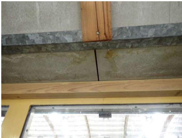
Kuva 116. Kattovuotoon viittaava jälki kenttien välillä.
