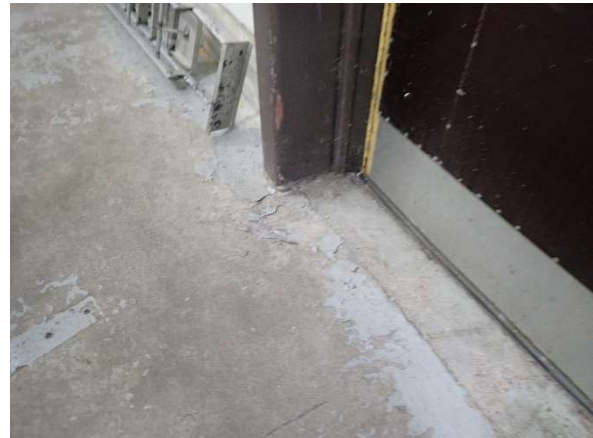
Kuva 9. Alapohjan pinnoitteet ovat kuluneet betonilaatan päältä.
