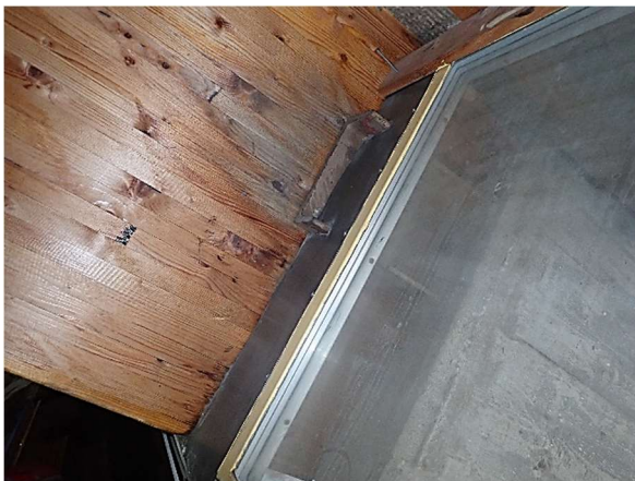
Kuva 118. Ilmavuotoja ja kosteuden tiivistymistä liimapuukaaren ja ulkoseinän liittymässä.
