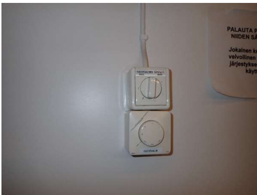
Kuva 202. Kuntosalin poistoilmaa johdetaan manuaalisesti erillisellä kanavapuhaltimella.
