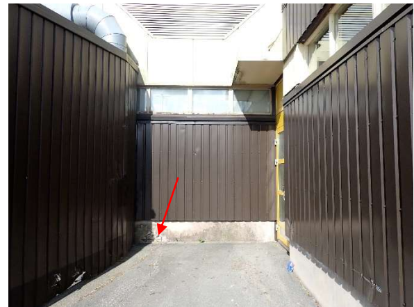
Kuva 75. Sokkelissa on kosteusrasitukseen viittaavia jälkiä koko näkyvällä osalla. Rakenneavauskohta merkitty nuolella.
