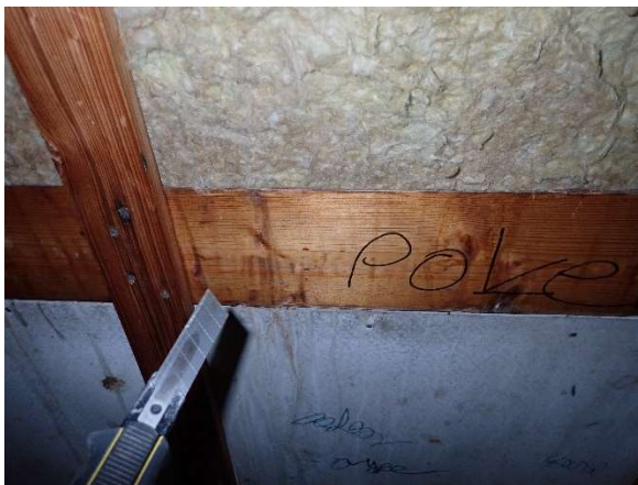
Kuva 163. Rakenneavauskohdan ulkopinnassa on voimakkaita kosteusjälkiä.
