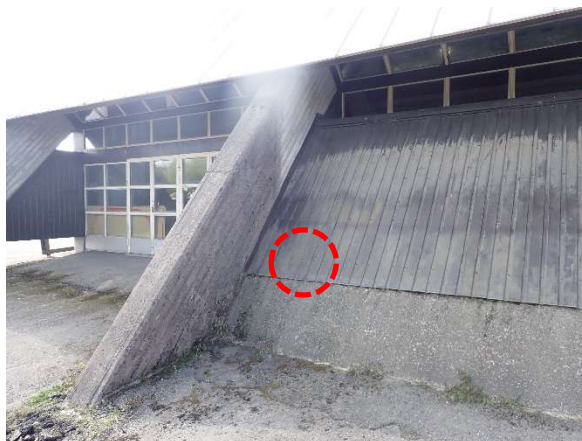
Kuva 66. Rakenneavaus US1 tehtiin ulkoseinän kaltevalle pinnalle. Peltiverhouksen alla ei ole tuuletusväliä.
