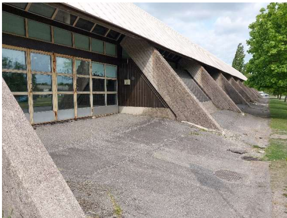
Kuva 52. Betoniin perusrakenteisiin kohdistuu voimakasta kosteusrasitusta. Vesi valuu esteettä jäähallin katolta betonirakenteiden päälle.
