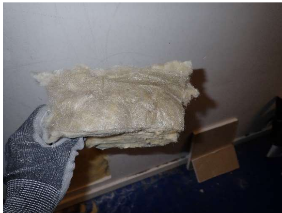
Kuva 102. Mineraalivillassa on ilmavuotoon viittaavia tummentumia.
