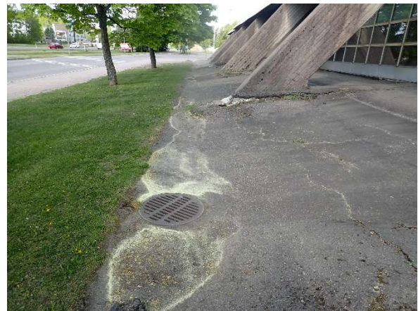
Kuva 180. Sadevesiviemärin kansi on muuta maanpintaa korkeammalla.
