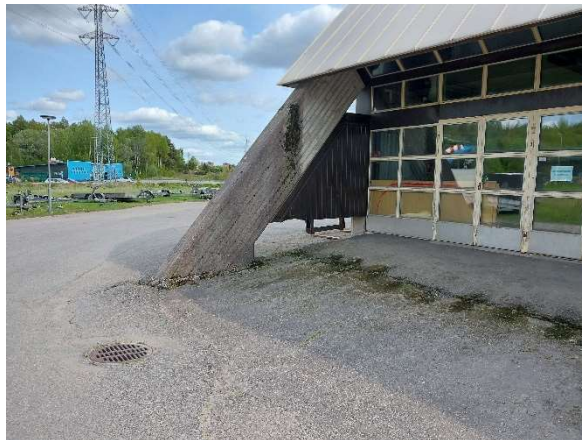
Kuva 175. Maanpinta kallistaa rakennuksesta pois päin, mutta räystääslinjan alapuolelle kohdistuva voimakas kosteusrasitus on mahdollistanut sammaleen kasvamisen asfaltin pintaan.
