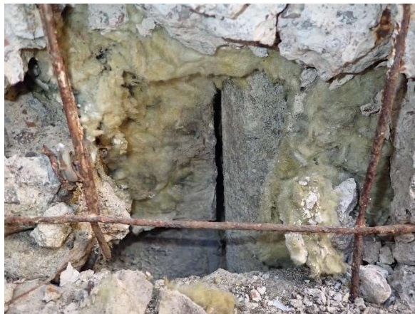
Kuva 74. Harjateräsverkkojen korroosiovauriot viittaavat pitkään jatkuneeseen kosteusrasitukseen.
