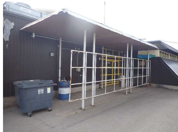
Kuva 147. Katoksen jäykistys on heikentynyt, rakennelma liikkuu voimakkaasti jalkojen alla katoksen päällä kuljettaessa.
