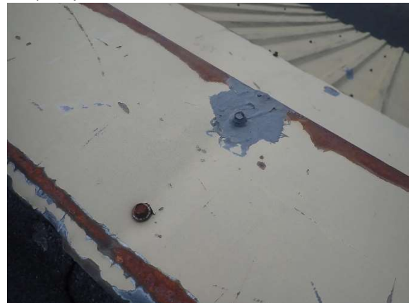
Kuva 137. Laajempia korroosiovauriota jäähallin ja sosiaali-tilan liittymässä.
