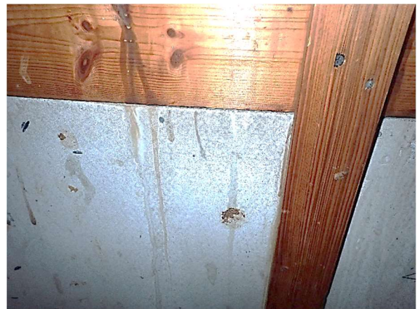
Kuva 119. Voimakkaita kosteusjälkiä hallin keskiosassa.
