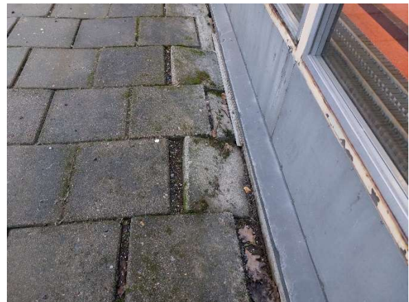
Kuva 182. Kiveys ohjaa vettä ulkoseinää vasten sisäänkäynnin kohdalla. Viiltokosteusmittausten perusteella muovimatto oli vaurioitunut tältä osin.
