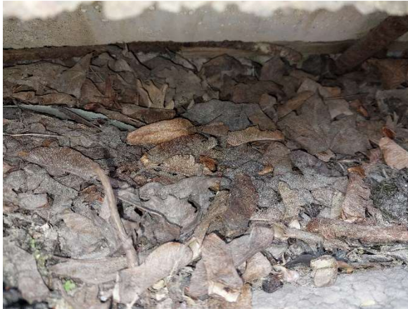
Kuva 177. Rakennuksen alle on kulkeutunut lehtiä ja muita epäpuhtauksia.
