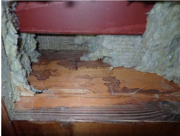
Kuva 165. Liimapuupalkin alareuna on vaurioitunut kosteus- rasituksen seurauksena rakenneavauskohdan vierestä.
