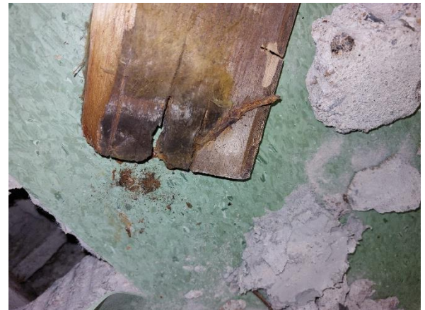
Kuva 83. Rakenneavaus VP2. Muottilaudoitus on lahovaurioitunut.
