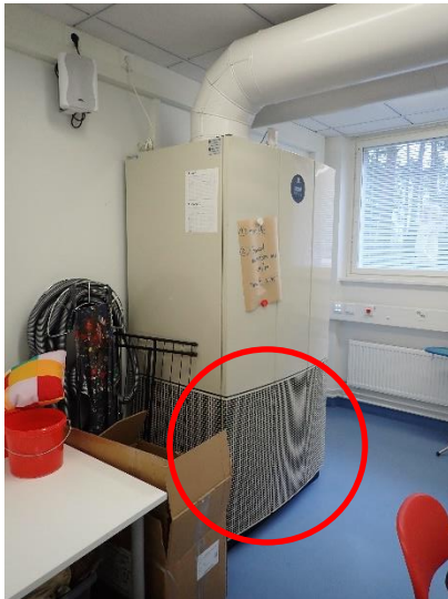
Kuva 105. Tuloilma ohjataan luokahuoneeseen iv-koneen alaosasta. Poistoilma ohjataan iv-koneen päältä.
