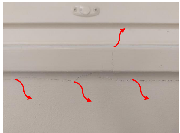
Kuva 55. Ikkunapenkkiin liitoksissa havaittiin halkeamia, joiden kautta ilmavirtaukset rakenteista sisäilmaan ovat mahdollisia.
