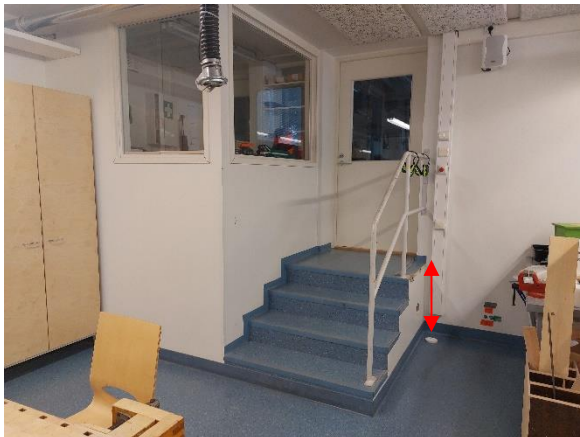
Kuva 23. Konesalin ja käytävän 004 alapohjarakenteen korkeusasema on puutyöluokan 008, käytävän, varaston 006 ja tekstiilityöluokan 007 alapohjarakennetta korkeammalla.
