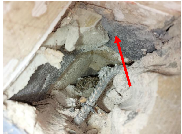
Kuva 22. Alapohjaliitosta on pyritty tiivistämään korjausten yhteydessä solumuovitiivisteellä. Liitoksessa ei havaittu elastista tiivistemassaa, joka tiivistäisi liitoksen ilmatiiviiksi.
