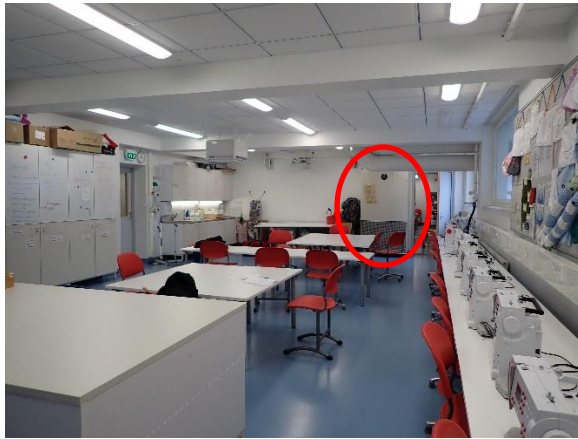
Kuva 103. Tekstiilityö 007 ilmastointikone on asennettu lyhyelle seinustalle. Tulo- ja poistoilma ohjataan iv-koneen yhteydessä olevien päätelaitteiden kautta.
