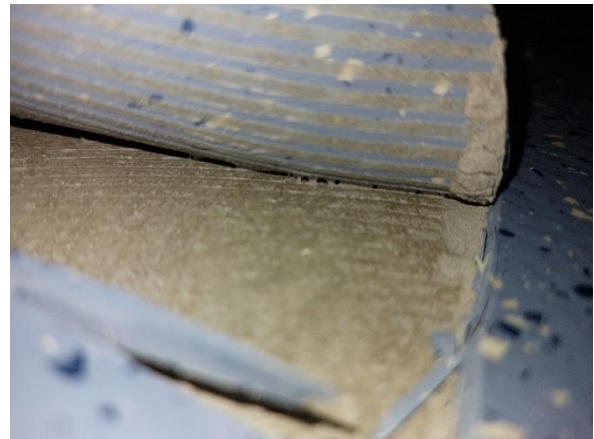
Kuva 20. Viiltokosteusmittaus VM2. Paikoin muovimattopäällysteen alapinnalla havaittiin lievästi venyvää mattoliimaa.
