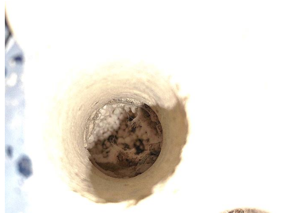
Kuva 18. Rakenneavaus AP2: Betonilaatan ja lämmöneristeen välissä havaittiin suodatin- tai valukan-gasta.
