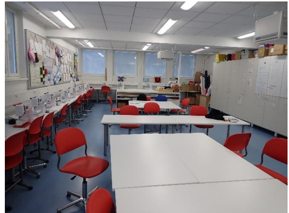
Kuva 104. Kuva ilmastointikoneelta luokan perälle päin. Tuloilma ohjataan iv-koneen alaosassa sijaitsevan tuloilmapäätelaitteen kautta.
