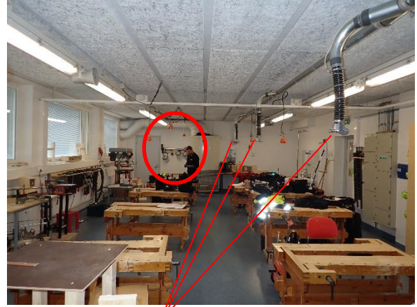
Kuva 114. Tilaan on asennettu kolme käsiohjauksella toimivaa kohdepoistoa. Kuva luokan perältä iv-koneen suuntaan.
