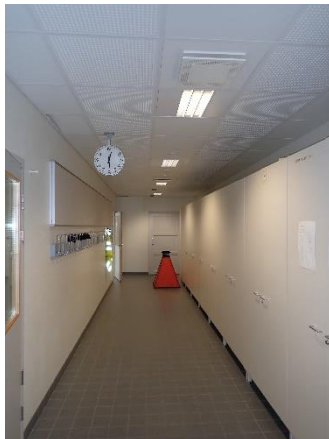
Kuva 117. Tilojen 007 ja 008 yhteydessä oleva käytävätila. tilan perällä puuvarasto, johon sijoitettu mm. ko. käytävän ilmanvaihtoa ohjaava ilmanvaihtokone.
