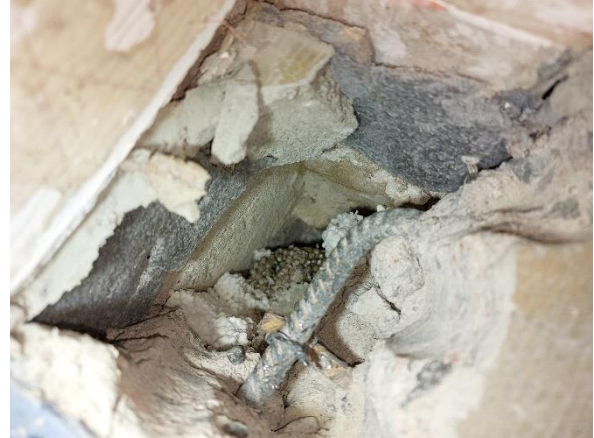
Kuva 16. Rakenneavaus AP1: Alapohjarakenteen ja ulkoseinän liitoksessa on solumuovikaista. Alapohjarakenne on havaintojen perusteella uusittu pohjalaatan pinnalta ylöspäin.
