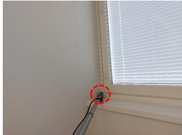
Kuva 92. Merkitäinekoe MAK3: Ulkoseinärakenteen ja ikkunan liitoksessa havaittiin pistemäinen ilmavuotokohta.
