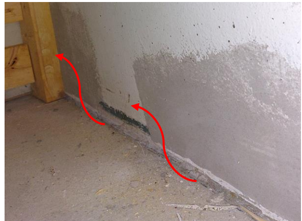
Kuva 24. Alapohjarakenteen pintalaatan ja maanvastaisen ulkoseinän liitoksessa havaittiin porrusrakenteen alapuolella kuivumiskutistumasta aiheutunut rako, joka on todennäköisesti epätiivis.
