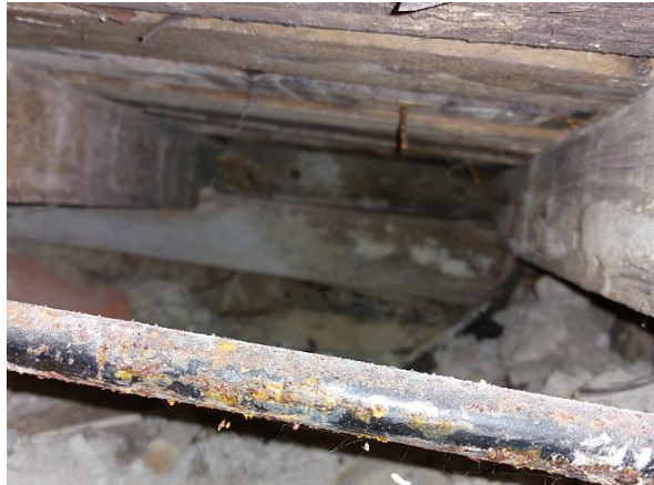
Kuva 80. Rakenneavaus VP1. Välipohjarakenne on alalaattarakenteinen ja kotelorakenteissa havaittiin muottilaudoitukset sekä rakennusjätettä.
