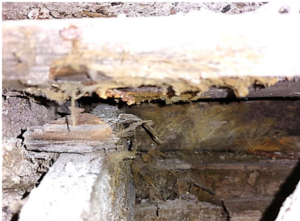
Kuva 82. Rakenneavaus VP2. Rakenteen toteutustapa vastaa avauksessa VP1 havaittua rakennetta. Ulkoseinän liitoksessa havaittiin lahovaurioituneita muottilaudoituksia ja aistinvaraisesti havaittavaa mikrobikasvustoa.
