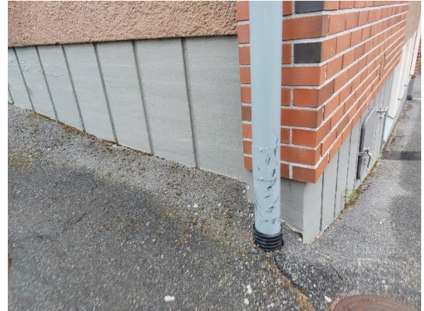
Kuva 99. Rakennuksen vesikatolta sadevedet ohjautuvat syöksytorvin sadevesijärjestelmään. Syöksytorvessa havaittiin avattavat puhdistusluukut.
