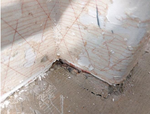
Kuva 15. Rakenneavaus AP1: Pintalaatan ja ulkoseinä-rakenteen sekä pilarin liitoksissa havaittiin rako.
