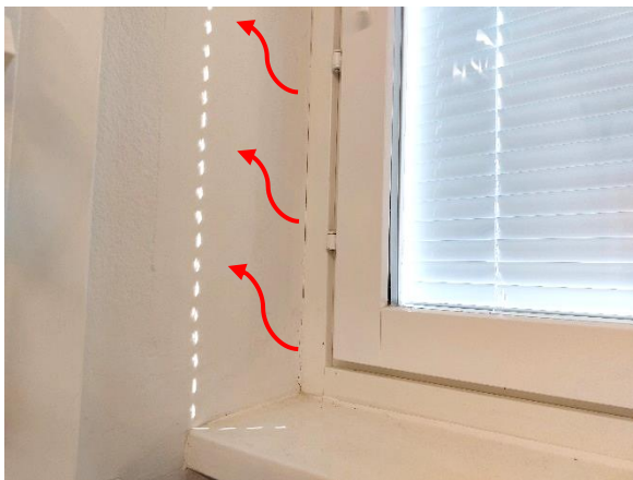
Kuva 54. Ikkunaliitoksissa havaittiin rakoja, joiden kautta ilmavirtaukset rakenteista ovat mahdollisia.
