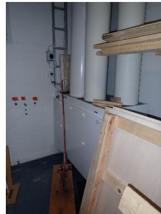
Kuva 118. Ilmanvaihtokone sijoitettu puuvarastoon. Ilmanvaihtokonehuoneita ei ole tarkoitettu varastotiloiksi.
