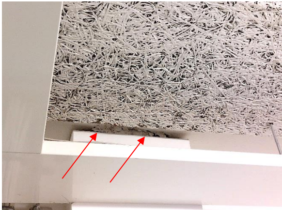
Kuva 88. Paikoin välipohjarakenteessa havaittiin todennäköisesti epätiivitä läpivientejä. Valokuva puutyön luokasta 008.
