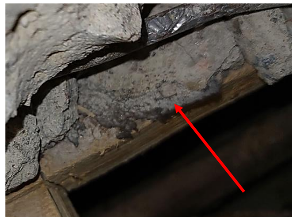
Kuva 79. Rakenneavaus VP1. Pintalaatan ja muottilaudoituksen välissä on tervapaperi, jossa havaittiin
