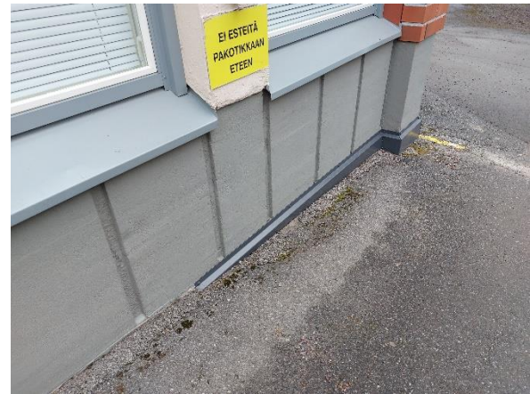
Kuva 34. Tekstiilityön ulkonurkan alueella havaittiin sokkelin vierustalla lista. Listaa avaamatta ja kaivantoa tekemättä perusmuurilevyn olemassaoloa ja sen toteutustapaa ei voida luotettavasti arvioida.
