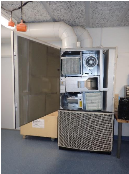
Kuva 115. Puutyötilan iv-koneen sivuille asetettu tavaroita, jotka osittain estävät tuloilmavirtausta.
