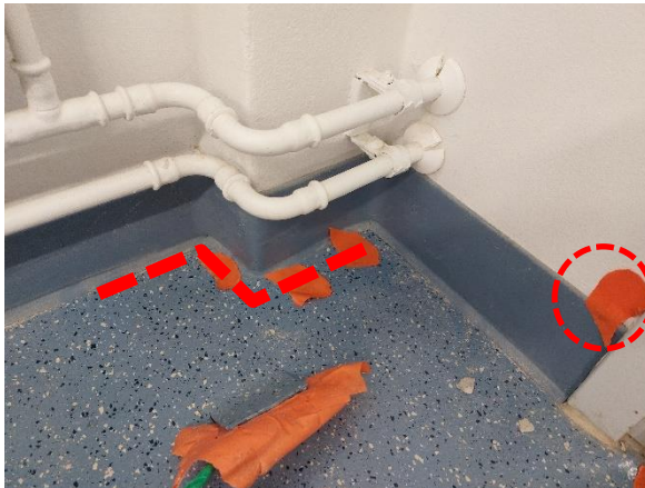
Kuva 27. Merkitseminen kokeissa MAK1: Vähäistä ilmavuotoa havaittiin alapohjarakenteesta ulkoseinän ja betonirakenteisen pilarin liitoksesta sekä pistemäistä ilmavuotoa alapohjan ja väliseinän liitoksesta.
