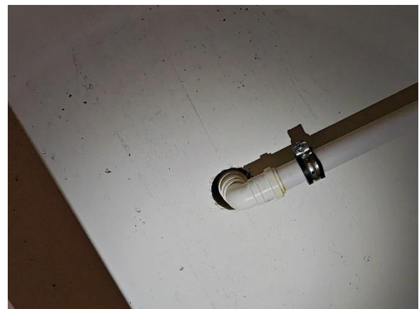
Kuva 74. Paikoin välipohjarakenteiden läpiviennit ovat epätiivitä, eivätkä todennäköisesti täytä välipohjarakenteen palo-osastointivaatimuksia. Valokuva varastosta 006.
