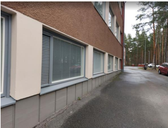
Kuva 102. Maanpinta kallistaa rakennuksesta lievästi pois päin.
