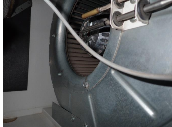
Kuva 120. Oppilashuollon TK puhaltimen siivekkeet olivat melko likaiset.
