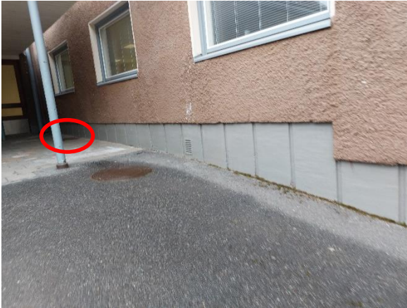
Kuva 98. Yksittäinen salaojan tarkastuskaivo oli kuiva, joka voi viitata tukokseen salaojajärjestelmässä. Kuiva tarkastuskaivo on merkittynä kuvaan punaisella ympyrällä. Kuvassa etummainen kaivo on sadevesien tarkastuskaivo.
