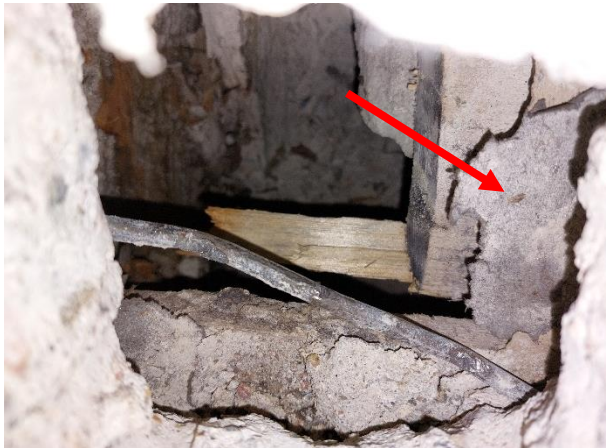
Kuva 84. Rakenneavaus VP2. Muottilaudoituksen ja pintabetonilaatan välissä on tervapaperi, jonka PAH-yhdistepitoisuus ylittää vaarallisen jätteen raja-arvon. Tervapaperissa havaittiin lisäksi heikko viite mikrobivauriosta.
