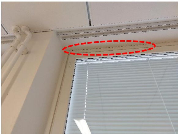
Kuva 58. Merkitsemissä kokeissa MAK4: Ikkunaliihosten kautta havaittiin vähäistä ilmavuotoa sisätiloihin.
