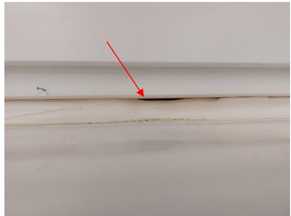
Kuva 43. Ikkunaliitos on sisäpinnaltaan tiivistetty elastisella massalla ulkoseinärakenteeseen. Massassa havaittiin epätiiveyttä.
