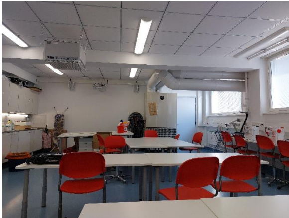
Kuva 71. Tekstiilityön luokan sisäkattoon on kiinnitetty mineraalivillarakenteiset akustiikkalevyt.
