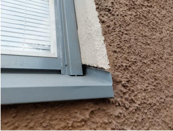
Kuva 66. Ikkunoiden pellitykset on havaintojen perusteella toteutettu asianmukaisesti. Ikkunat on uusittu havaintojen perusteella vuonna 2017.
