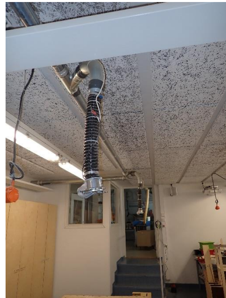
Kuva 116. Puutyö 008 tilassa kolme käsiohjattavia kohdepoistoja.
