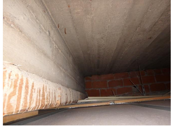
Kuva 76. Välipohjarakenteet ovat betonirakenteisia. Välipohjarakenteen alapinnalla on paikoin muottilaudoituksia. Kuva oppilashuollon alueelta toimistosta 133.
