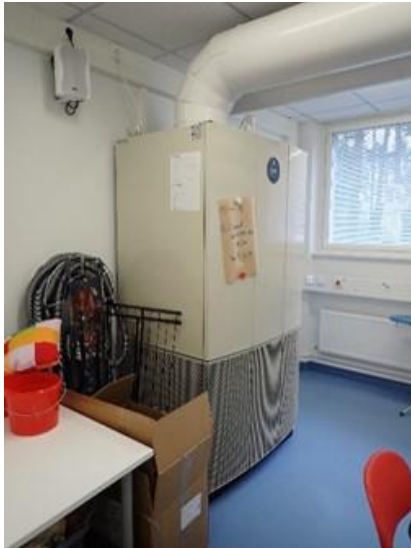
Kuva 109. Ilmanvaihtokoneen sivulla on varastoituna tavaraa, jotka estävät tuloilman ohjautumista.
