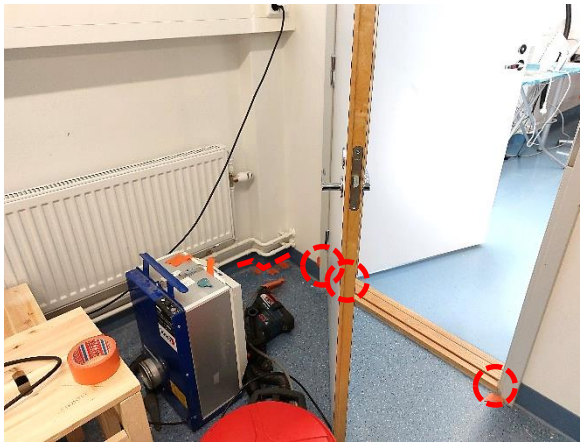
Kuva 25. Merkitseminen kokeissa MAK1 puutyö 008 tilassa havaittiin alapohjarakenteesta ilmavuotokohtia, jotka on merkitty kuvan punaisilla ympyrillä.
