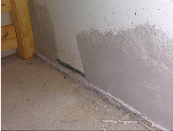
Kuva 96. Rakenneavaus PORRAS1: Alapohjarakenteen pintalaatan ja maanvastaisen ulkoseinän liitoksessa havaittiin kuivumiskutistumasta aiheutunut rako.
