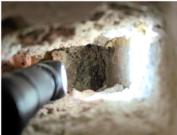
Kuva 42. Pilarin takana havaittiin eristeenä lastuvilla-sementtilevy. Ikkunapenkin ja pilarin välissä havaittiin valupaperia.
