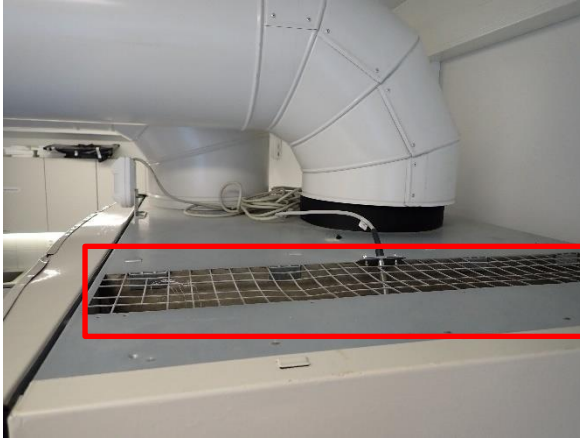
Kuva 107. Poistoilma ohjataan iv-koneen päällä sijaitsevan poistoilmapäätte-elimen kautta.
