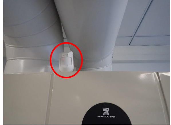
Kuva 108. Ilmanvaihto toimii luokan ollessa tyhjänä asetetulla minimiteholla. Liiketunnistimella ohjataan il-määrää luokkaan saavuttaessa.
