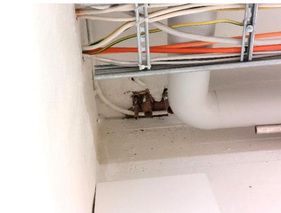
Kuva 73. Paikoin välipohjarakenteessa havaittiin epätiivitä läpivientejä ja todennäköisesti asbestipitoisia putkieristeitä sekä käytöstä poistettuja putkia. Valokuva varastosta 006.
