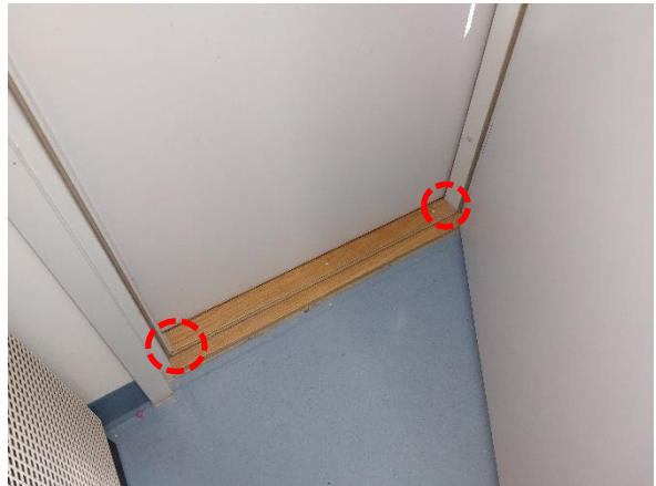
Kuva 28. Merkitseminen kokeissa MAK1: Puutyöluokan 008 ja tekstiilityön luokan 007 välioven kynnyksen alueella havaittiin vähäistä ilmavuotoa alapohjarakenteesta.
