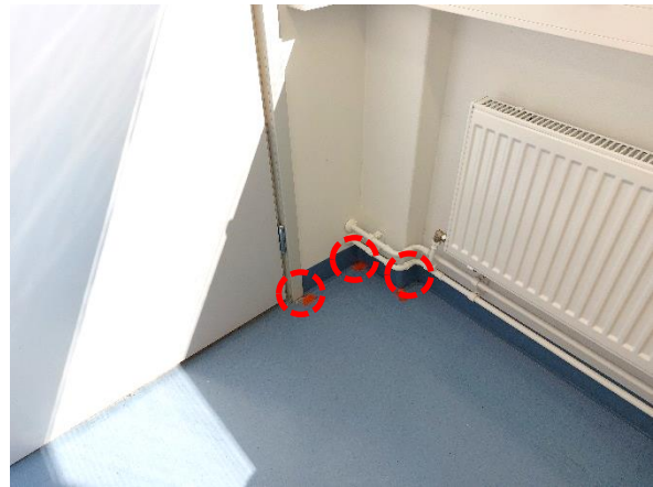
Kuva 26. Merkitseminen kokeissa MAK1 tekstiilityö 007 alueella alapohjarakenteesta havaittiin pistemäisiä ilmavuotokohtia, jotka on merkitty kuvan punaisilla ympyrillä.
