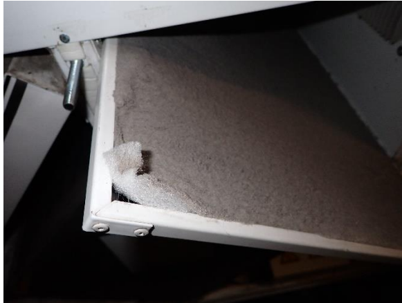
Kuva 119. suodattimet ovat vaihdon/puhdistuksen tarpeessa.
