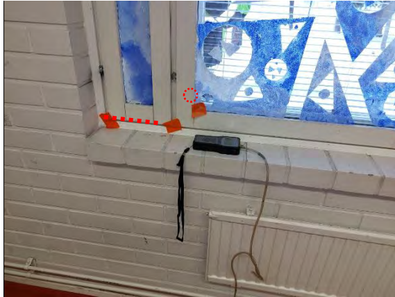
Kuva 122. Merkkiainekoe MAUS1 tehtiin ulkoseinä-rakenteeseen luokassa 173. Havaitut ilmavuotokohtat on merkittynä kuvaan punaisella.
