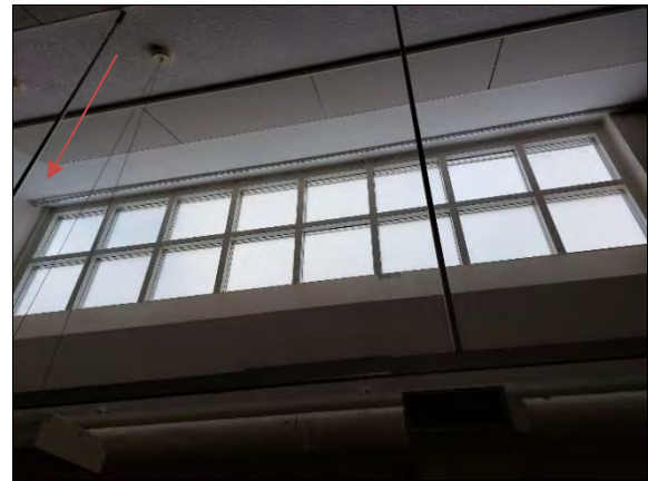
Kuva 105. Ikkunan saumamassa halkeilee.
