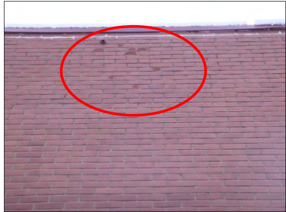
Kuva 73. Tiilien pinta on paikoitellen rapautunut.
