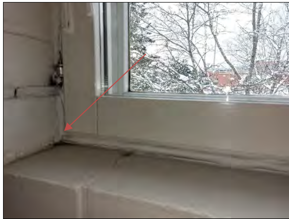
Kuva 104. Ikkunaliitos on epätiivis. Saumamassa halkeilee.
