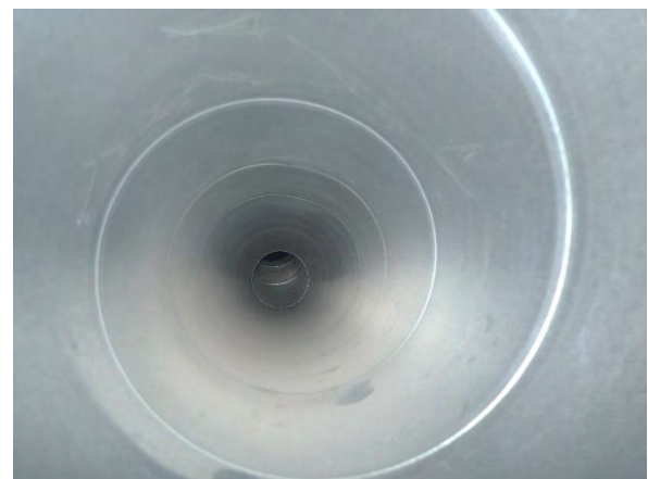
Kuva 197. Ilmanvaihtokanavat olivat melko puhtaat. Seuraava nuohoustarve noin 2 vuoden sisällä.
