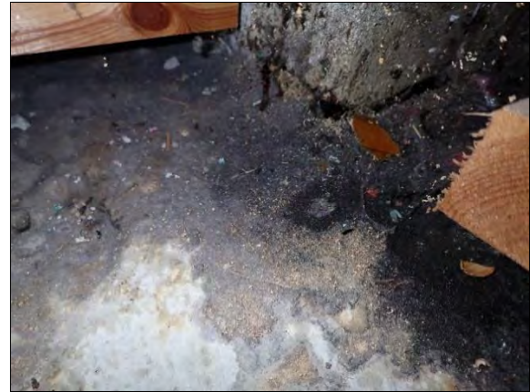
Kuva 29. Rakenneavaus AP4: Betonilaatan pinnassa on bitumisively.
