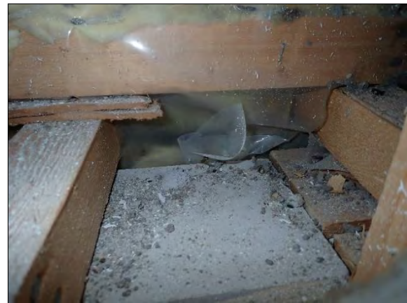
Kuva 98. Yleiskuvaa avauksesta US 13. Kotelossa havaittiin rakennusjätettä. Höyrynsulku ei ole tiivis ja avauksesta oli aistittavissa selkeä ilmavirtaus sisään päin.
