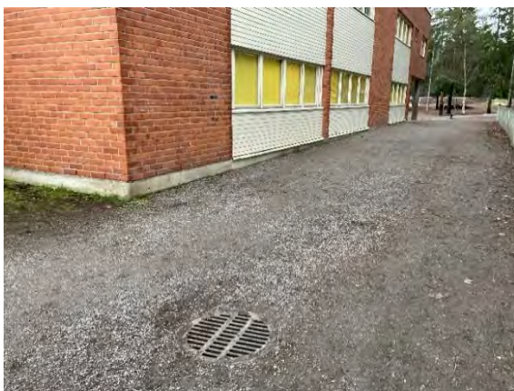
Kuva 182. Rakennuksen länsipuolella maanpinta viettää rakennusta kohti.
