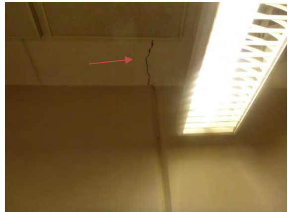
Kuva 168. Ontelolaatassa halkeama luokkahuoneessa 222.
