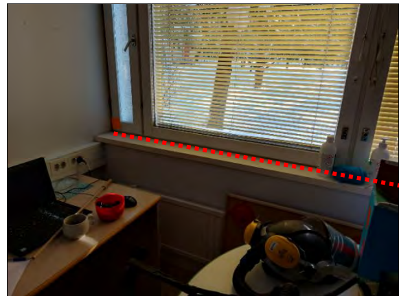
Kuva 125. MAUS3: Havaittiin ilmavuotoa ikkunoiden liitoksista huoneessa 130.
