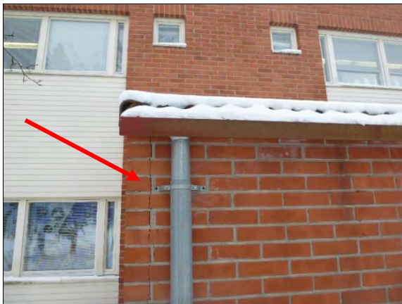
Kuva 62. Halkeama varaston seinässä.
