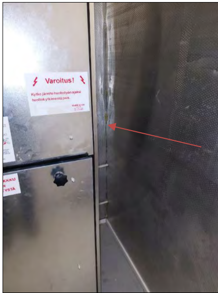
Kuva 128. Ilmanvaihtokonehuoneen väliseinässä on näkyvää villaa.
