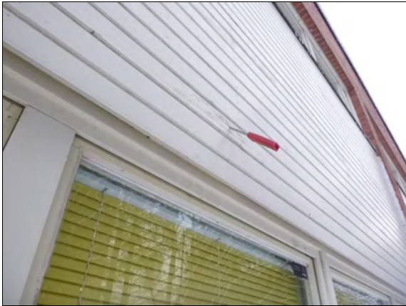
Kuva 66. Puuverhoilu on yksittäisistä kohdista lahonnut.
