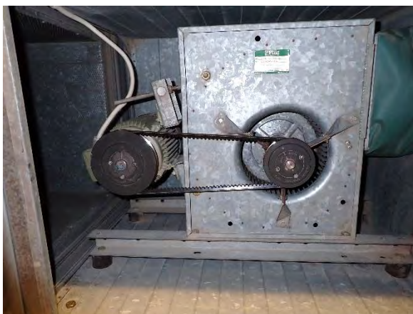
Kuva 196. Ilmanvaihtokoneet ovat ylittäneet käyt- töikänsä.
