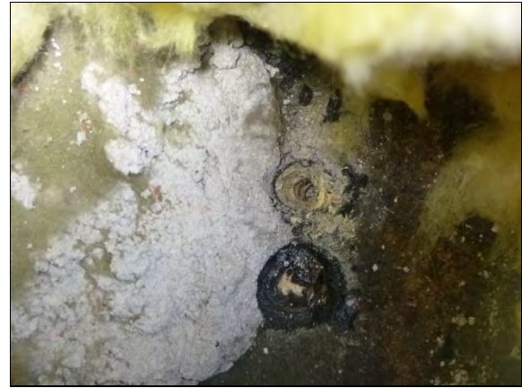
Kuva 103. US 13. Alaohjauspuussa on vanhoja piettyjä sähköjohtojen suojauputkia.
