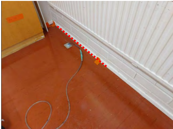
Kuva 36. Merkkiainekokeissa MAAP1 huoneessa 177 havaittiin alapohjarakenteen ilmapuotokohtia, jotka on merkittynä kuvaan.
