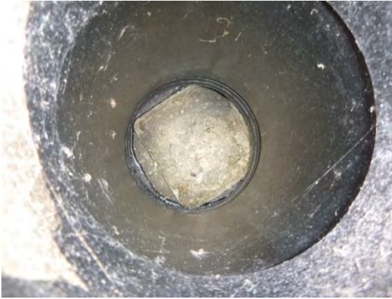
Kuva 159. Vesikaton tuuletusputken kohdalla oleva kerrin alapuolinen mineraalivilla estää osin tuuletuksen toimivuutta.
