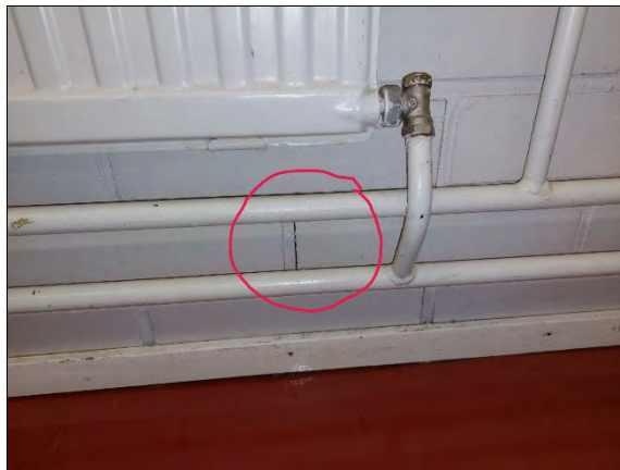
Kuva 106. Tiilien saumoissa on rakoja, joista tulee ilmaa vuotoa.
