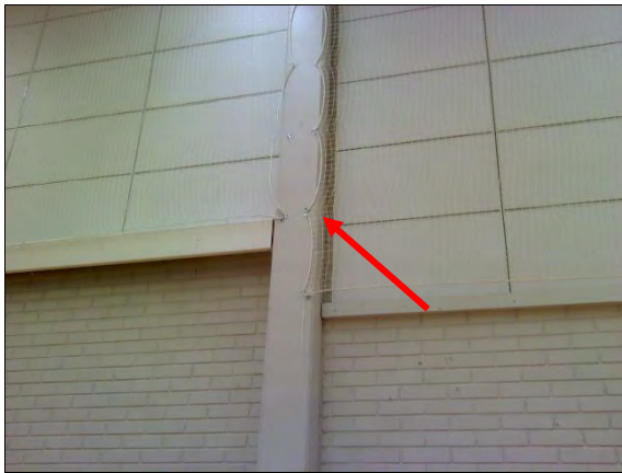
Kuva 110. Halkeama tiilimuurauksen ja pilarin liitoskohdalla.
