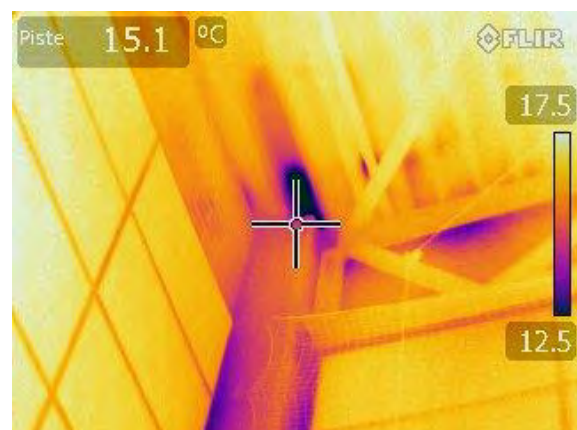
Kuva 175. Edelliden kuvan lämpökamerakuva. Pistemäisiä ilmavuotokohtia.
