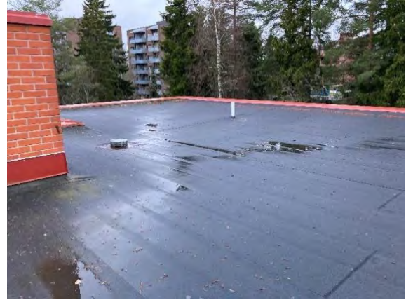
Kuva 148. Paikoin vesikatolle lammikoituu pienialaisesti vettä.
