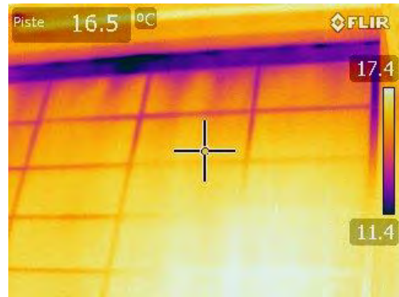
Kuva 171. Edellisen kuvan lämpökamerakuva. Ilmavuotoa ulkoseinän ja yläpohjan liitoskohdalla.
