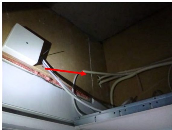
Kuva 108. Ulkoseinissä havaittiin paikoin tiivistämättömiä läpivientejä.
