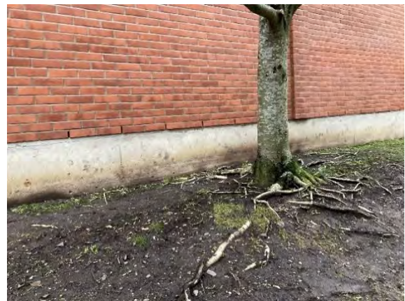
Kuva 177. Rakennuksen itäpuolella kasvaa suuria puita, joiden juuret ulottuvat rakennuksen sokkelirakenteisiin.
