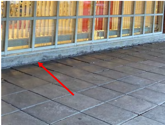
Kuva 178. Sokkelissa jälkiä kosteuden noususta ja kalkkihärmää.
