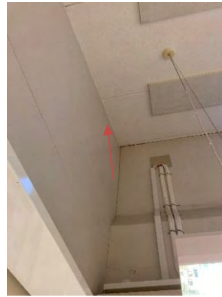
Kuva 166. Yläpohjan ja ulkoseinän liittymässä saumaus halkeilee.
