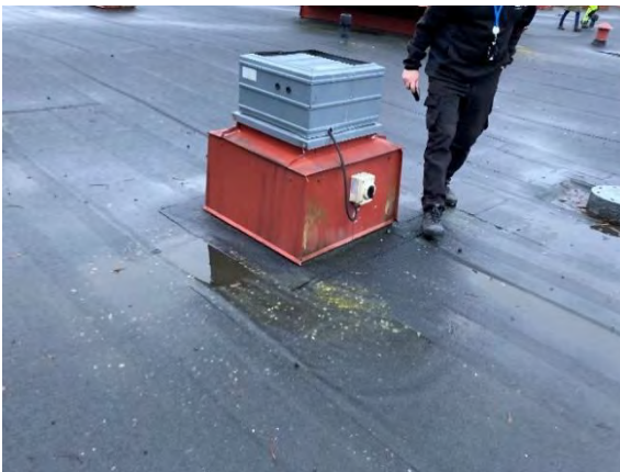
Kuva 157. Vesi lammikoituu huippumurin läpiviennin kohdalle.
