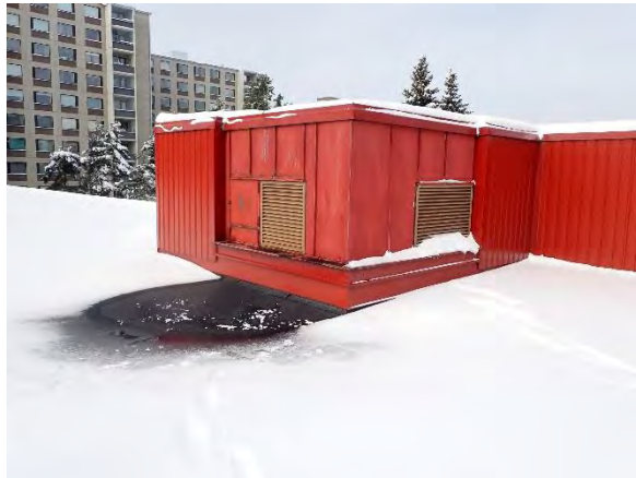
Kuva 186. Jäteilma sulattaa lumen. Tuulisissa olosuhteissa jäteilma voi ohjautua ja sekoittua sisälle tuotuun raittiiseen ilmaan. Raittisilmäsäleikön korkeus kattopinnoista mahdollistaa lumen kulkeutumiseen tuloilmakoneeseen.
