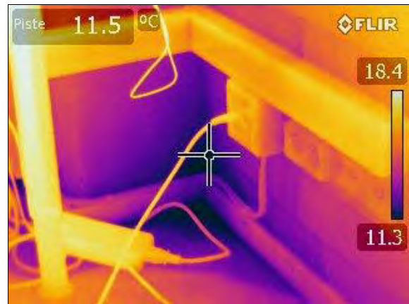
Kuva 117. Lämpökamerakuva edellisen kuvan kohdalta. Ilmavuotoa halkeaman kohdalta.
