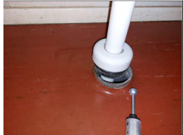
Kuva 8. Luokka 176. Epätiivis viemäriputkiläpivienni.
