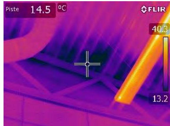
Kuva 173. Edelliden kuvan lämpökamerakuva. Osittainen lämmöneristeputee tai ilmavuotoa liitoskohdalla.
