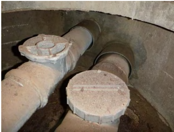
Kuva 13. Tilan 165 viemäriputkien läpiviennit ovat avoimia ja alapohjan hiekka hieman kosteata.
