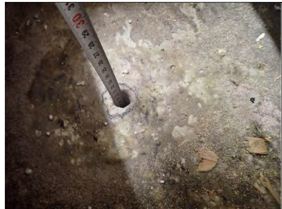
Kuva 33. Betonin pinnalla on hieman roskaa.
