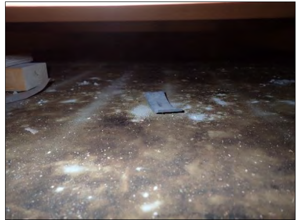
Kuva 31. Lattian puukannen alla on jonkin verran roskaa.
