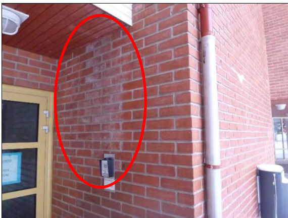
Kuva 70. Tiilimuurauksessa jälkiä kosteuskuormituksesta.
