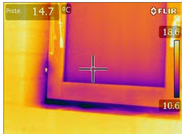
Kuva 121. Lämpökamerakuva edellisen kuvan kohdalta. Ilmavuotoa ikkunan sisäpuolteen tiivisteiden kohdalta.
