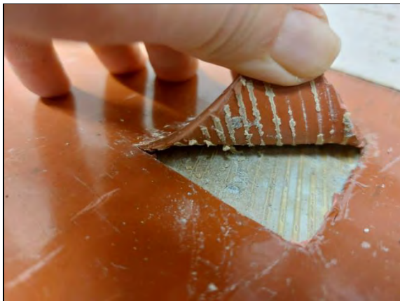
Kuva 34. Muovimaton alapinnan kosteutta mitattiin viiltokosteusmittausmenetelmällä. Kuvassa viiltokosteusmittaus VM1, huoneessa 137. Matossa, liimassa tai tasoitteessa ei havaittu merkkejä kosteuskuormituksesta.
