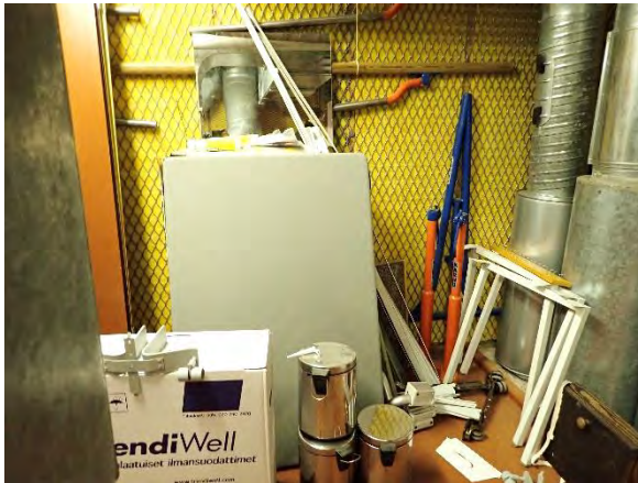
Kuva 194. Ilmanvaihtokonehuoneiden eristeet ovat nä- kyvissä ja pinnoittamatta.
