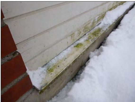
Kuva 76. Puuverhoillun julkisivun alareunassa on merkkejä kosteuskuormituksesta. Pellityksestä irtoaa maali.
