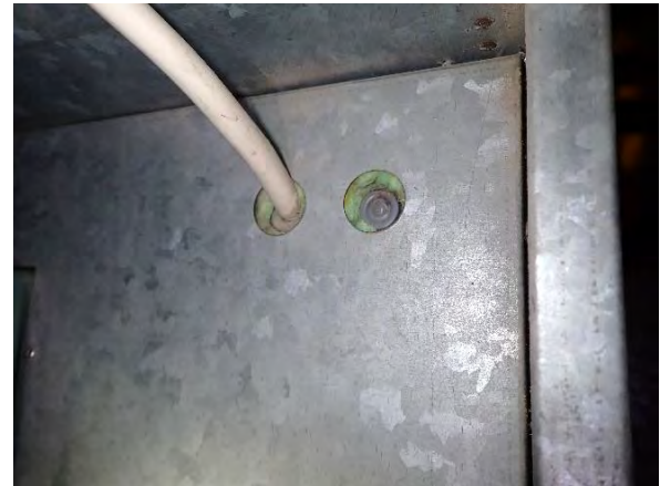
Kuva 195. Ilmanvaihtokoneiden kammioissa pinnoitta- mattomia eristeitä.
