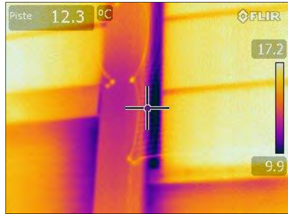
Kuva 111. Lämpökamerakuva edellisen kuvan kohdalta. Ilmavuotoa halkeamasta.
