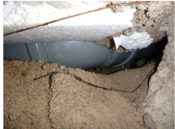
Kuva 14. Tilan 115 alapohjan luukusta on yhteys alapohjan alapuolisiin täyttömateriaaleihin. Täyttö on osin painunut viemäriputken alapuolella.
