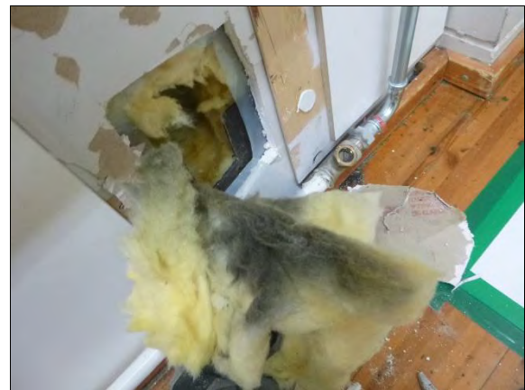
Kuva 101. Lämmöneristevilloissa olevia tummentumia.
