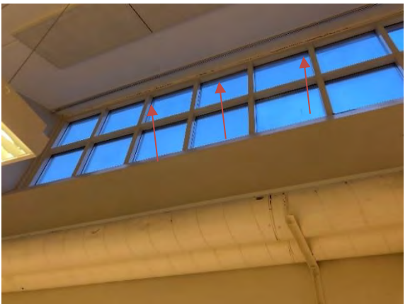
Kuva 164. Kuvaa sisäpuolelta. Ontelolaatan ja ikkunan liittymän tiivisteessä rako.
