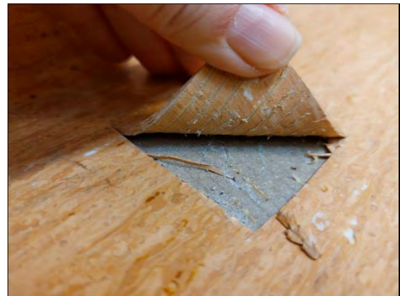
Kuva 35. Viiltokosteusmittauspisteissä, lattiapäällysteenä oli muovimatto. Kuvassa viiltokosteusmittaus VM2 huoneessa 139. Matossa, liimassa tai tasoitteessa ei havaittu merkkejä kosteuskuormituksesta.
