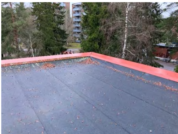
Kuva 151. Vesikatteen reuna-alueilla on vähäisesti lehtikertymää ja jäkäläkasvustoa.
