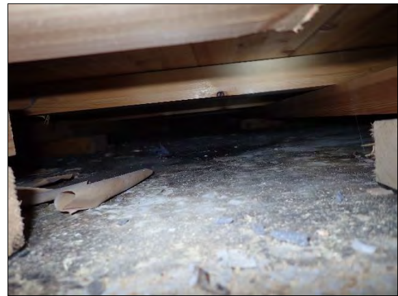
Kuva 27. Rakenneavaus AP 7: Lattialaudoituksen alla on tyhjä tila, jossa on rakennusjätettä.
