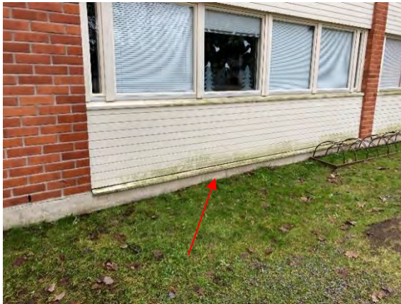
Kuva 184. Kosteusjälkiä ulkoseinien puuosissa.
