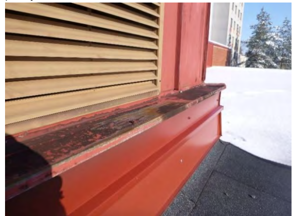
Kuva 158. Ilmanvaihtokonehuoneen vesipellitys kaataa seinään päin.
