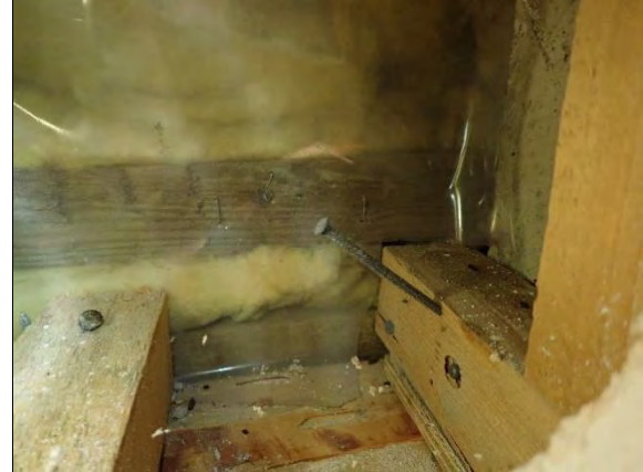
Kuva 96. Yleiskuvaa avauksesta US 6. Runkopuissa ja kotelon alapinnan lastulevyssä havaittiin vanhoja kosteusjälkiä. Höyrynsulku ei ole tiivis ja avauksesta oli aistittavissa selkeä ilmavirtaus sisään päin.
