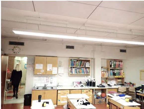
Kuva 192. Tulo- ja poistoilmapäätelaitteet samalla seinustalla.
