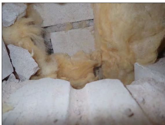
Kuva 135. Väliseinäavaus VS 1 tehtiin maalaushuoneeseen 121. Avauksesta oli aistittavissa selkeä mikrobiperäinen haju. Seinän mineraalivillasta otetussa näytteessä todettiin viite vauriosta.
