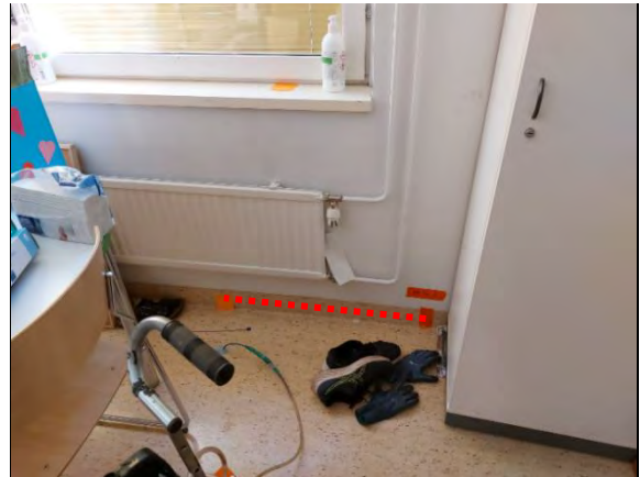
Kuva 37. Merkkiainekoe MAAP3 tehtiin huoneen 130 alapohjarakenteeseen. Ilmapuotoa havaittiin alapohjan ja ulkoseinän liitoksesta.
