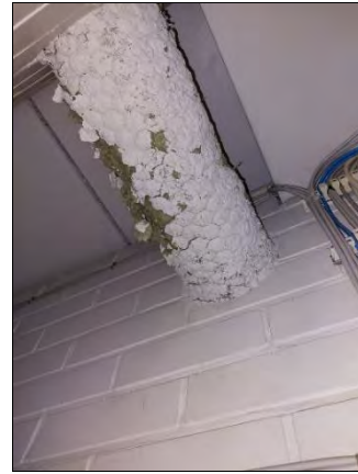
Kuva 43. Avointa mineraalivillapintaa putkieristeessä sähkökaapissa 168.
