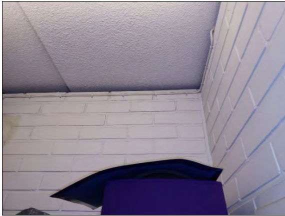
Kuva 42. Välipohjan ja väliseinän liitos on tiivistämättä varastossa 167.
