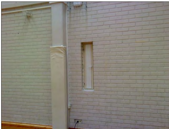
Kuva 112. Ikkunan sisäpuoliset liitoskohdat ovat tiivistämättömiä.
