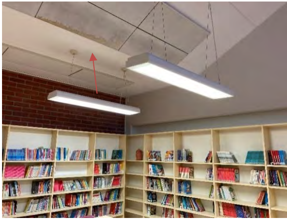
Kuva 165. Kirjaston akustiikka levyissä oli havaittavissa kuivuneita kosteusjälkiä.
