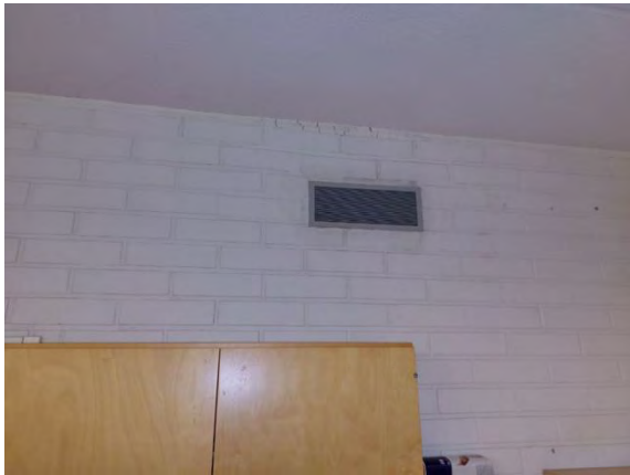
Kuva 44. Saumamassa halkeilee väliseinän ja välipohjan liitoksessa luokassa 176.
