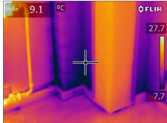
Kuva 115. Lämpökamerakuva edellisen kuvan kohdalta. Nurkan lämmöneristyksessä on mahdollisesti puutteita tai rakenteen liitoskohdissa on ilmavuotoa.
