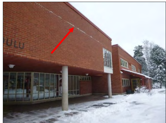
Kuva 71. Tiilimuurauksessa jälki. Mahdollisesti vanha vaakahalkeama on paikattu laastilla.
