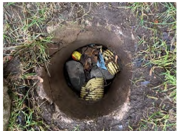
Kuva 181. Tarkastuskaivoista havaittuna salaojaputket ovat liian korkealla maanpintaan nähden. Tarkastuskaivossa on roskaa ja isoja kiviä.
