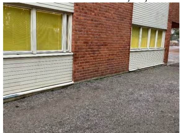
Kuva 183. Sokkeli erittäin matala rakennuksen länsipäädystä.
