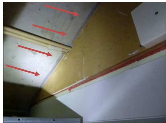
Kuva 109. Keittiön tuulikaapin ulkoseinän höyrynsulkua ei ole tiivistetty yläreunasta.
