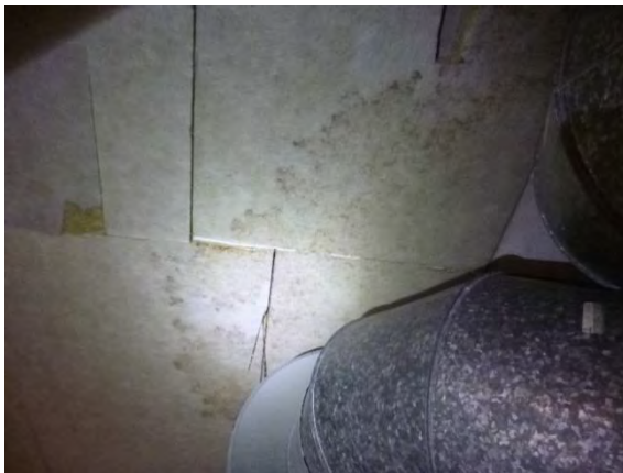
Kuva 169. IV-konehuoneen katossa kuivunutta vuotojälkeä.
