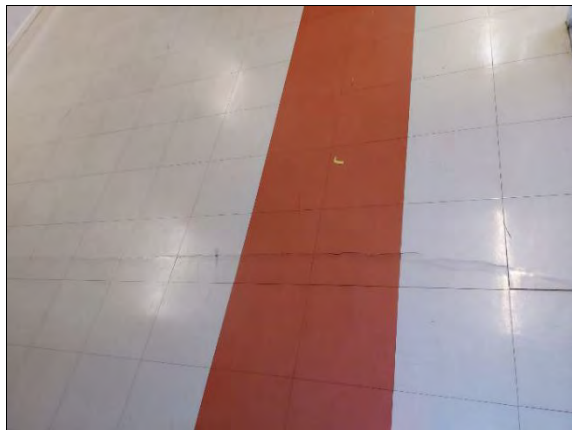
Kuva 40. Käytävällä 227 vinyylilaattapäällyste halkeilee.
