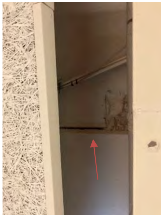
Kuva 167. Ontelolaattojen saumassa rako opettajainhuoneen käytävällä.
