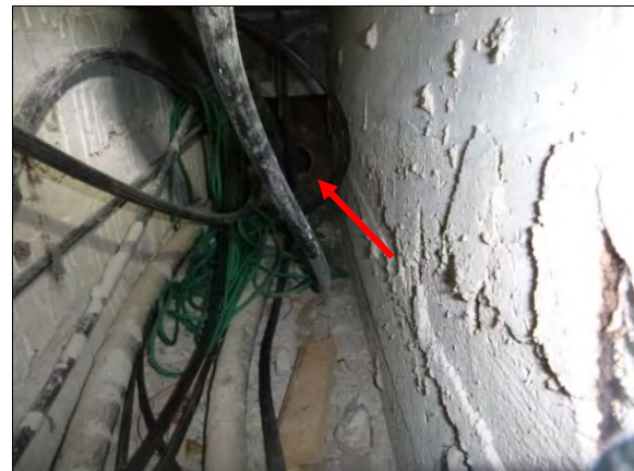
Kuva 16. Tilan 157 kaapelikourun päässä on hiekkatäyttöä ja avoimia suojaputkia.
