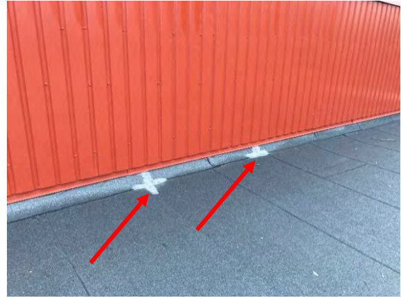
Kuva 154. Kermien saumakohtia on paikkamassattu yksittäisestä kohdasta liikuntasalin katon korotus-osassa.
