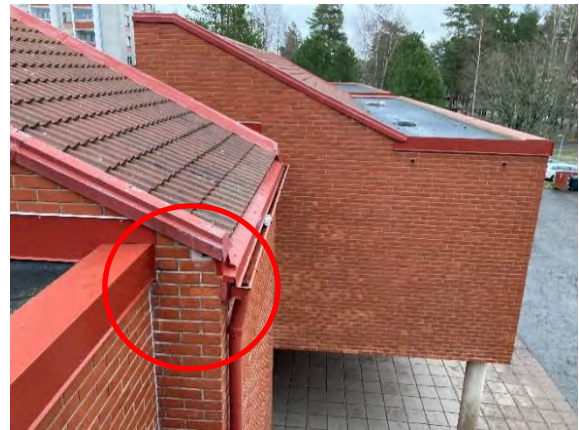
Kuva 150. Porrashuoneen vesikaton vanha purettu sisäpuolinen sadevesikouru on kastellut seinärakennetta.
