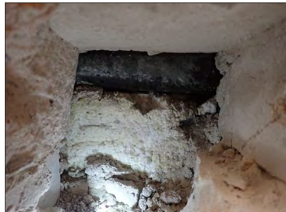
Kuva 81. Sokkelin rakenneavaus (AP7/US) liikuntasalissa 181.
