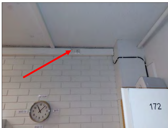
Kuva 132. Merkkiainekoe MAUS1 tehtiin ulkoseinära- kenteeseen luokassa 173. Havaitut ilmavuotokohdat on merkittyä kuvaan punaisella.
