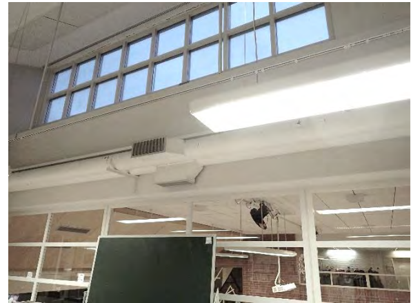
Kuva 193. Tulo- ja poistoilmapäätelaitteet samalla seinustalla.
