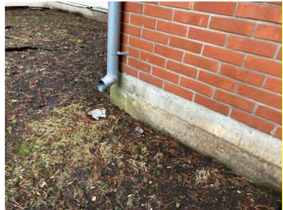
Kuva 179. Sadevedet ohjataan suoraan rakennuksen seinustalle.
