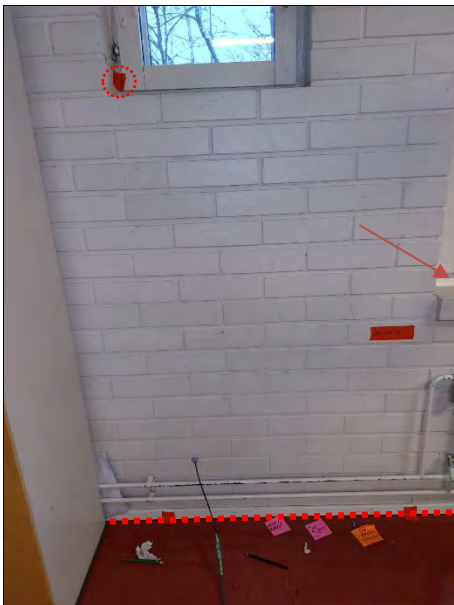
Kuva 124. MAUS4: Ilmavuotoa havaittiin luokassa 243 ikkunaliitoksista ja ulkoseinä-alapohjaliitoksesta sekä ulkoseinän ja pilarin liitoksesta.
