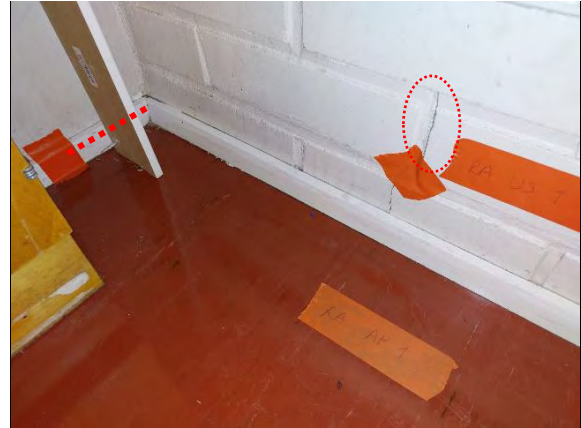
Kuva 123. MAUS2: Ilmavuotoa havaittiin luokassa 177 ulkoseinän ja alapohjan liitoksesta sekä tiilien välisestä halkeamasta.
