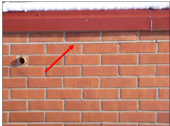
Kuva 75. Liikuntasalin ulkoseinän yläosassa olevaa vaakahalkeamaa.
