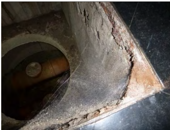
Kuva 15. Alapohjien luukuissa ei ole tiivistettä.
