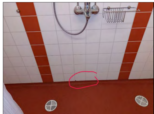
Kuva 127. Märkätiloissa väliseinän päällysteenä on keraaminen laatoitus. Suihkuseinän alaosan pintakosteus oli koholla.
