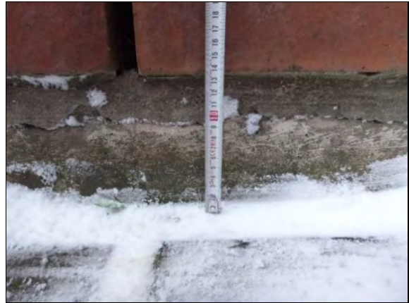
Kuva 61. Paikoin sokkelit ovat matalia ja pintabetonissa on halkeamia, jotka voivat viitata teräskorroosiovaurioon.
