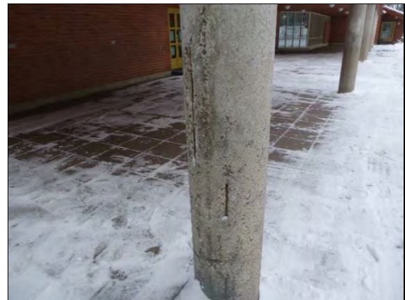
Kuva 77. Katoksen pilareissa havaittiin teräskorroosiovaurioita.
