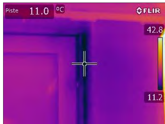
Kuva 119. Lämpökamerakuva edellisen kuvan kohdalta. Ilmavuotoa tiivistämättömästä liitoskohdasta.
