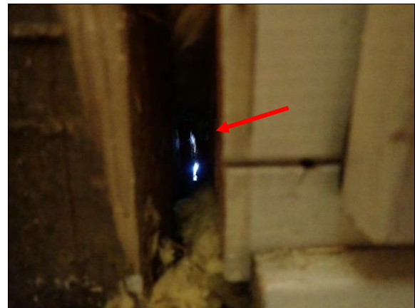
Kuva 107. Ikkunaliittymästä pilkistää valoa.
