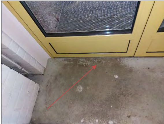
Kuva 7. Halkeama alapohjassa tilassa 182.
