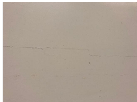
Kuva 133. Näyttämön takana tiilisessä väliseinära- kenteessa on pitkiä vaakahalkeamia.
