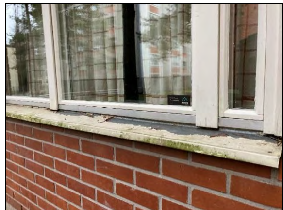
Kuva 65. Ikkunanpellitykset ovat loivia ja ikkunan ulkopuitteiden kunto on välttävä. Ikkunapeltien maalipinta hilseilee.
