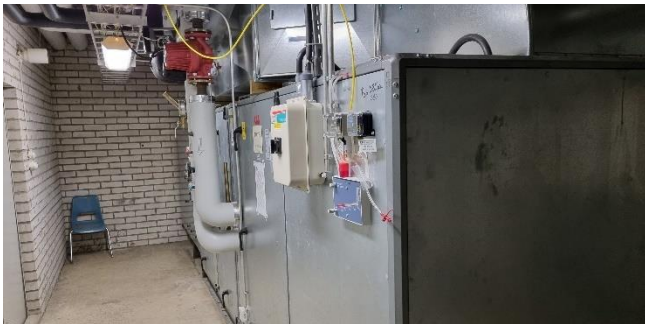
Kuva 119. Tuloilmakone TK1 IV-konehuoneessa 002.
