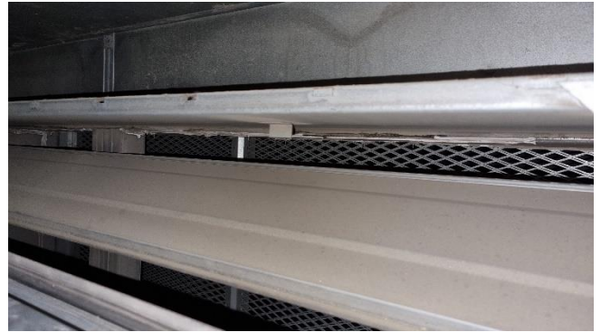
Kuva 153. Raitisilmapelti ei sulkeudu automaattisesti.
