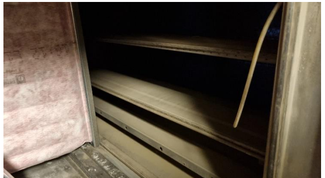
Kuva 163. Tuloilmakoneen TK8 likainen raitisilmapelti ei sulkeudu koneen pysähtyessä.
