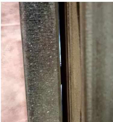
Kuva 164. Suodattimet eivät asennu tiiviisti.
