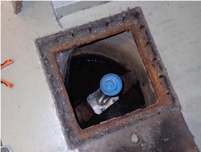
Kuva 65. Ampumaradan eteisen viemärin tarkastusluukku ei ole tiivis. Putki on alkuperäinen.
