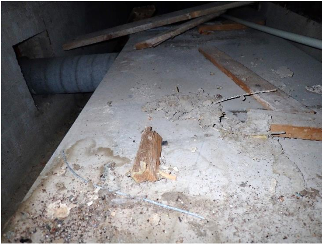
Kuva 62. Peltinen, suorakulmainen poistoilmakanava, josta haarautuu kanava keilaradan alle. Betonikanaalin muottilaudoitus on poistettu.
