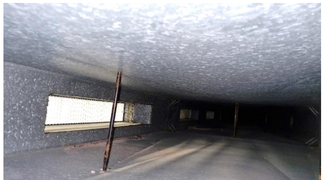
Kuva 159. Keilaradan takaosassa sijaitsevasta tuloilmakanavasta otetun geeliteippinäytteen KK9 kuitupitoisuus oli poikkeava.
