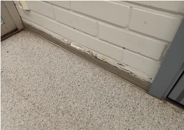
Kuva 20. Kosteusjälkiä käytävän 050 väliseinän alaosassa.
