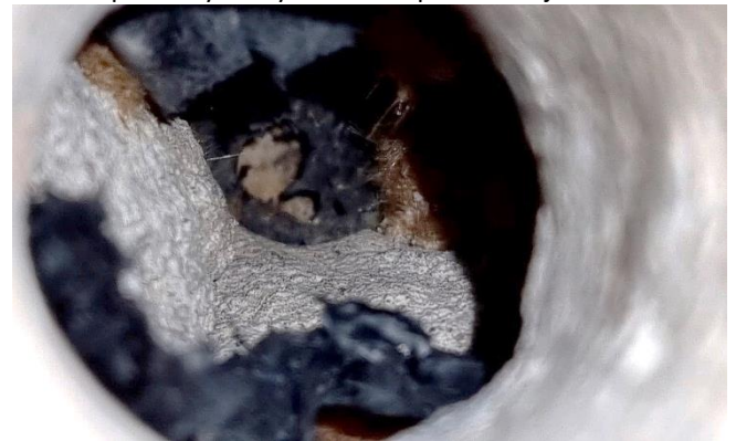
Kuva 59. Patterisyvennyksen pohjassa mineraalivillaeriste oli kahden muovin välissä.
