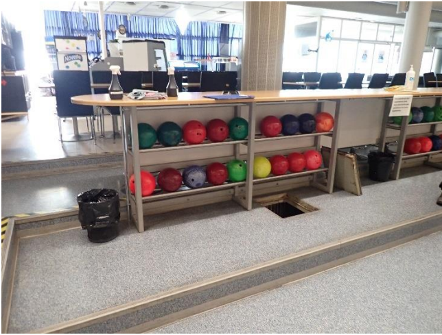
Kuva 22. Keilahallin kahvioissa sekä katsomon ylimmän tasanteen kohdalla (pallotelineen takana) lattianssa havaittiin kartoituksessa selviä kosteuseroja.
