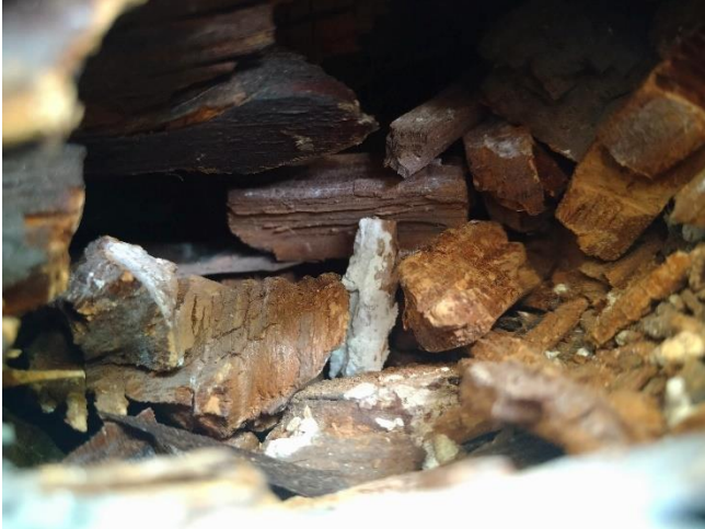
Kuva 94. Lähikuva liimapuupalkin lahovaurioalueelta.
