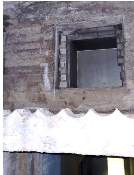
Kuva 122. Raitisilmakanavat koneille TK1 (yläpuolella) ja TK2 (alapuolella).
