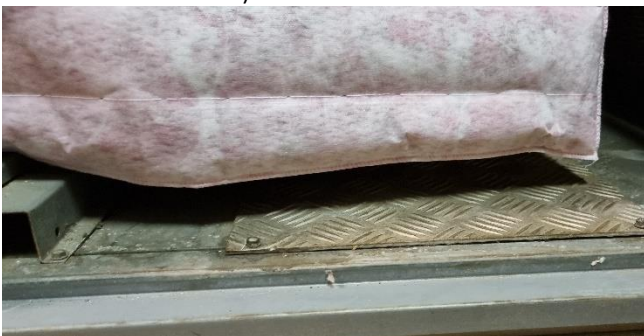
Kuva 135. Suodattimet (F7) ovat puhtaat, asettuvat tiivisti eivätkä ne ota kiinni kammion pohjaan.
