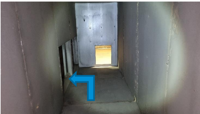
Kuva 133. Peltisessä raitisilmakammiossa ei ole viemärointiä. Kuva otettu raittiin ilman tulosuunnasta (nuoli kuvaa ilmavirtauksen suuntaa).
