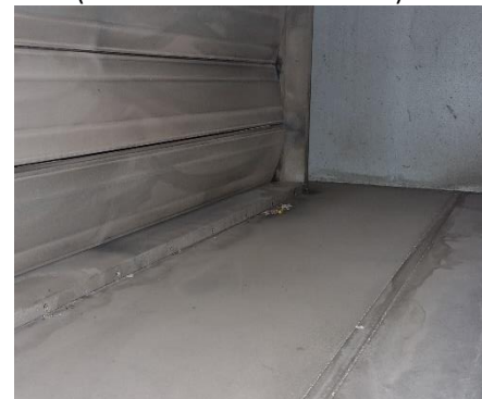
Kuva 134. Raitisilmapelti sulkeutuu automaattisesti koneen pysähtyessä, pellin takana on vähäisiä kosteusjälkiä.
