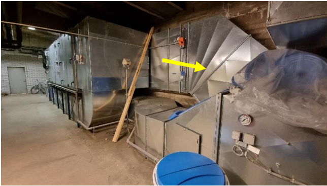
Kuva 152. Tuloilmakone TK6 TF1 (oikealla alla) käyttää kierätysilmaa (keltainen nuoli) kuvassa vasemmalla sijaitsevalta poistokoneelta TK6 PF1.
