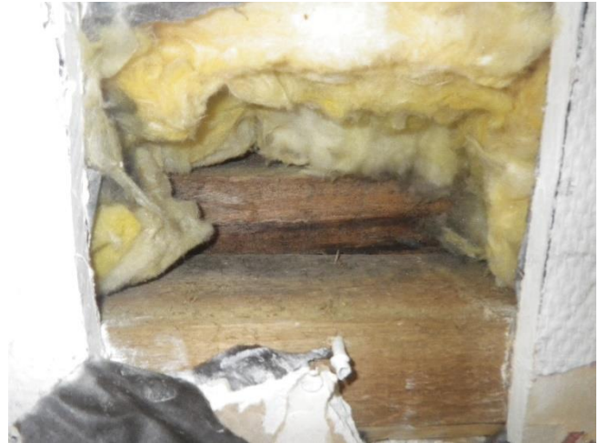
Kuva 47. Viereisen ulkoseinän alaohjauspuun ulkopinnassa olevan laudan sisäpinnassa on näkyvää, tummaa mikrobi- kasvustoa.
