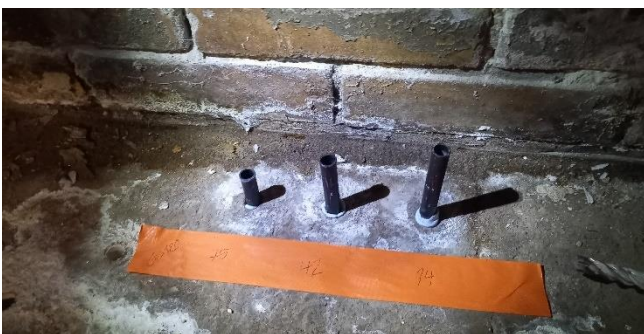
Kuva 30. Porareikämittauksessa PR1 todettiin IV-konehuoneen 001 alapohjarakenteen kosteuden olevan koko vahvuudeltaan poikkeava.
