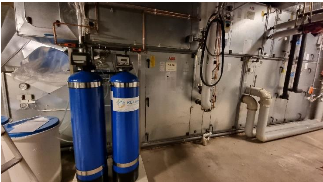
Kuva 162. Tuloilmakoneet TK6 (alla) ja TK8 (päällä).
