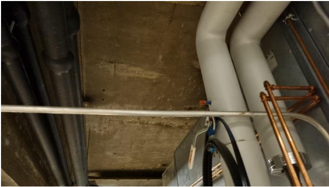
Kuva 102. IV-konehuoneen 038 katon pihakansirakenne oli laajoilta alueilta märkä.
