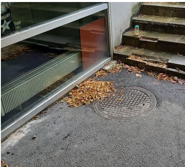
Kuva 12. Ampumaradan sisäänkäynniltä lähtevät huonokuntoiset portaat on otettu pois käytössä (aidattu yläpäästään). Portaiden juuressa on salaojien tarkastuskaivo.
