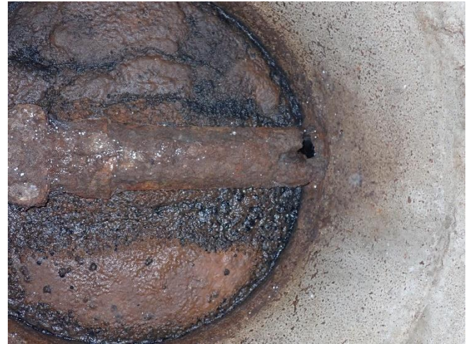
Kuva 66. Keilahallin tuulikaapin edustalla viemäriputki on syöpynyt puhki ja tarkastusluukun alta havaittiin voimakasta hajua.
