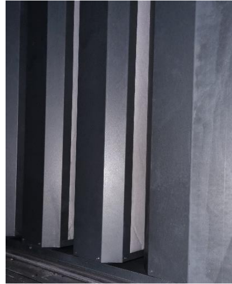
Kuva 146. Äänenvaimennuslamellit ovat hyväkuntoiset ja kuitujen irtoaminen niistä on estetty.
