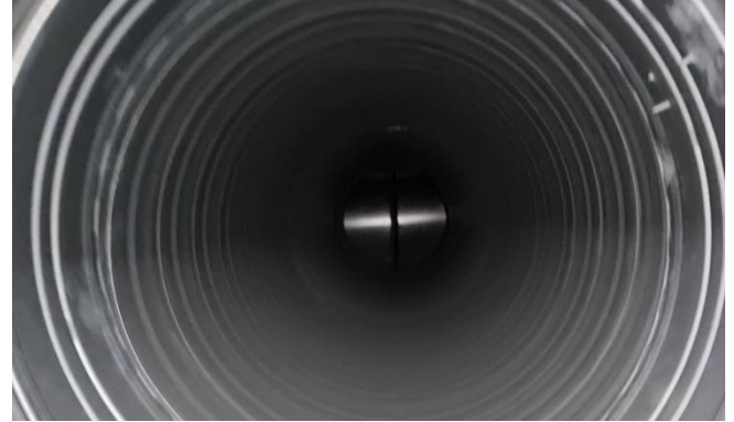
Kuva 167. Tuloilmakanavissa on runsaasti pölyä, pölyrajat ovat selvästi havaittavissa "klo kolmessa ja yhdeksässä".
