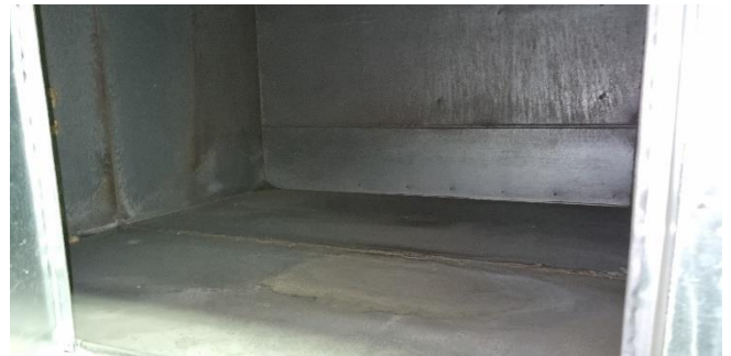
Kuva 120. Raitisilmakammio ei ole viemäröity, kammion pohjalla on vähäisiä kosteusjälkiä.
