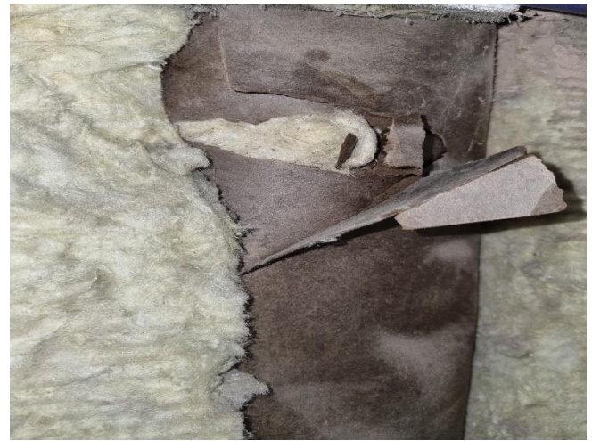
Kuva 79. Umpiosat ovat lämmöneristetty mineraalivillalla, joista otetuista näytteistä toisessa esiintyi poikkeavaa lajis-toa. Umpiosissa kulkee myös talotekniikan putkia.
