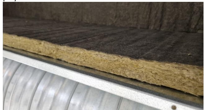
Kuva 128. Päätelaitteiden sisällä oli pinnoittamatonta mineraalivillaa, josta voi irrota kuituja tuloilmaan.
