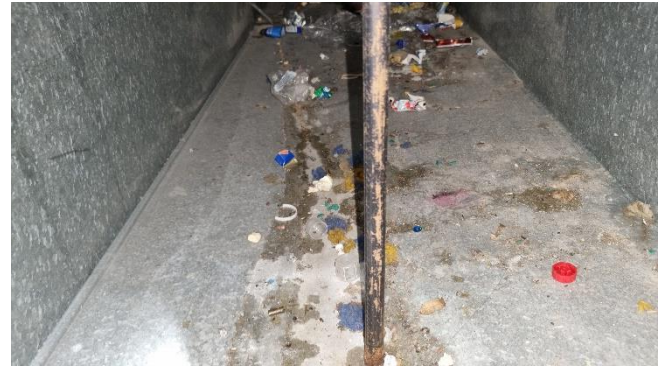
Kuva 150. Ikkunapuhalluskanavaan kertyy lattiapellitikkessä olevien reikien kautta runsaasti likaa.
