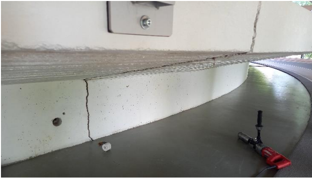
Kuva 84. Juoksuradan kaarteiden kallistuksia varten tehdyssä betonirakenteessa on molempien kaarteiden keskellä koko rakenteen läpi ulottuva halkeama.
