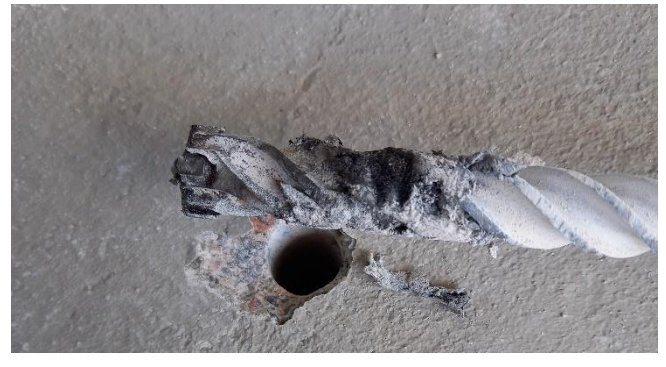
Kuva 105. Pukuhuoneiden yläpohjarakenteen kosteuseristeenä on bitumisively.
