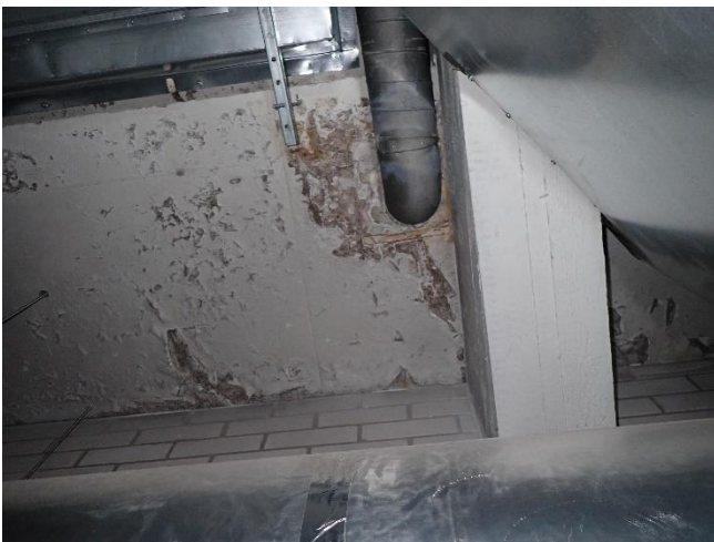
Kuva 98. Luoteispäädyn tilojen katoissa pihakannen alla on runsaasti kosteusvauriojälkiä, joiden kohdilla rakenteet olivat edelleen märkiä.
