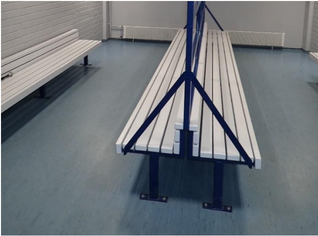
Kuva 18. Muovimattopintaisten pukuhuoneiden lattioissa havaittiin pintakosteuskartoituksessa laajoilla alueella poikkeavaa kosteuteen viittaavia lukemia.
