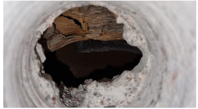
Kuva 85. Betonirakenteeseen jätetyt muottilaudat ovat laho- ja mikrobivaurioituneet. Halkeamasta kulkeutui sisätiloihin voimakasta mikrobiperäistä hajua.
