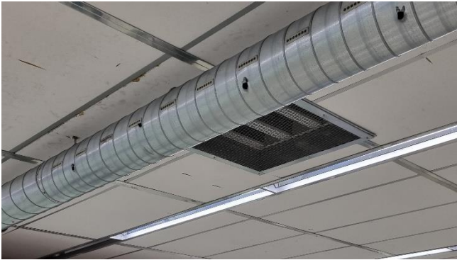
Kuva 125. Tuloilma jaetaan osin kanavien kyljessä olevien reikäsuuttimien kautta.
