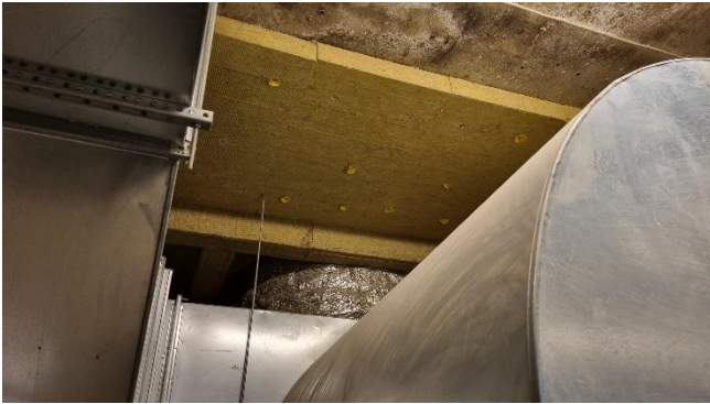
Kuva 149. IV-konehuoneen katossa on pinnoittamattomia mineraalivillalevyjä.
