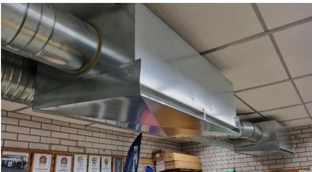
Kuva 127. Ampumaradalla oli myös erillisiä tuloilman päätelaitteita.
