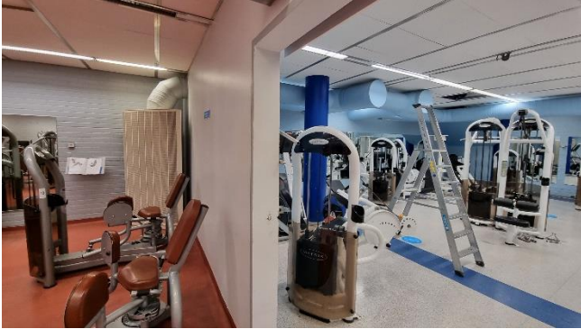
Kuva 166. Tuloilma jaetaan kuntosaleissa sekä kattohajottajin että kuvassa näkyvin syrjäyttävän ilmanvaihdon päätelaittein.
