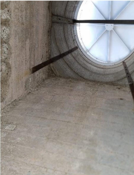
Kuva 121. Raitisilma otetaan rakennusaineisen kanavan kautta.
