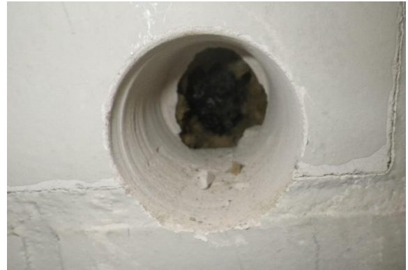
Kuva 67. Yleisin maanvastainen ulkoseinärakenne US1 poikkeaa lähtötiedoista betoniulkokuoren sisäpinnassa olevan, runsaasti PAH-yhdisteitä sisältävän bitumisivelyn osalta.
