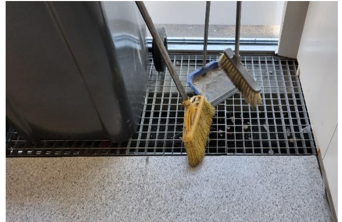
Kuva 57. Keilahallin ulkoseinustalla alapohjarakenteessa kulkeva patterisyvennys kerää helposti likaa ja roskaa.
