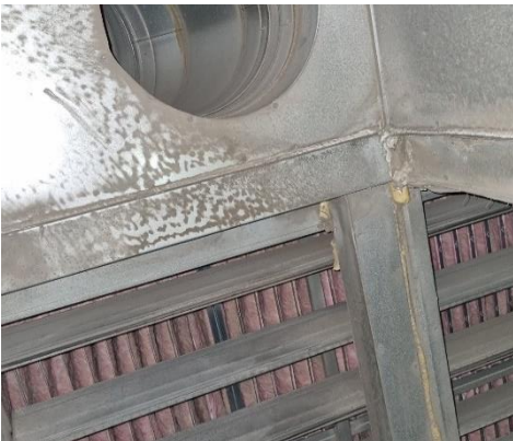
Kuva 123. Koneen TK1 raitisilmapelti (alla) ei sulkeudu koneen pysähtyessä. Yllä raitisilmakanavan pää.
