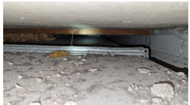
Kuva 87. Kanaalista voi kulkua pölyä ja muita epäpuhtauksia sisäilmaan tarkastusluukujen reunoilta ja "suutinlistan" liitoksesta.
