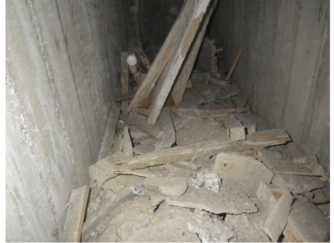
Kuva 83. Kuilujen lahovaurioista muottilaudoitusta on pudonnut kuilun pohjalle.
