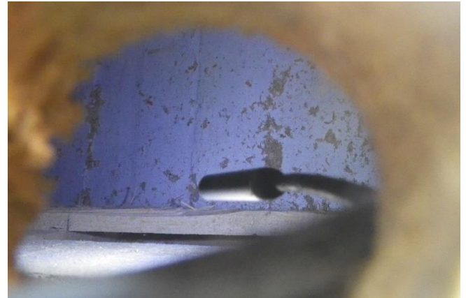
Kuva 44. Soutualtaan maali-/epoksinnoite on jätetty betonin pintaan. Tuulettumattomassa tilassa oli purua sekä vahva kemiallinen ja mikrobiperäinen haju.
