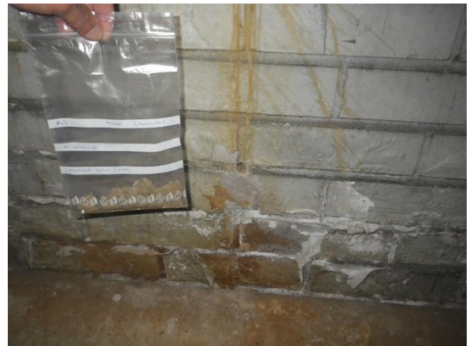
Kuva 69. Kosteusvauriojälkien kohdalta lämmöneristeistä otettu näyte M13 oli lajistoltaan poikkeava.
