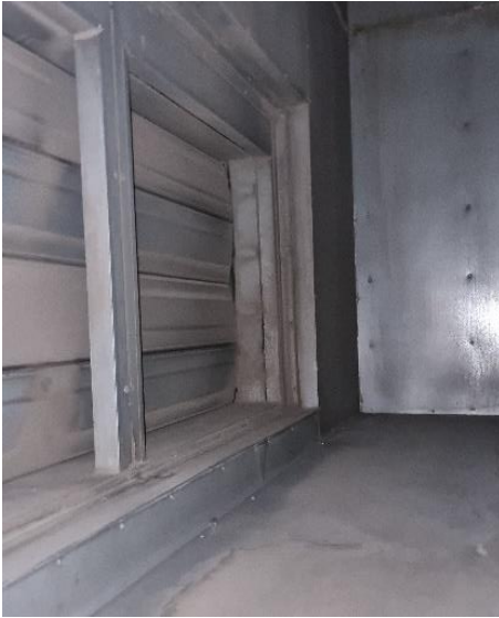
Kuva 145. TK5 raitisilmakammiossa on vähäisiä kosteusjälkiä, raitisilmapeltili sulkeutuu automaattisesti koneen pysähtyessä.
