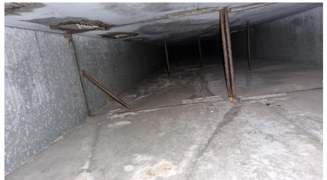
Kuva 142. Ikkunaseinustalla kulkeva kanava on likainen ja siinä on myös kosteuden aiheuttamia jälkiä.
