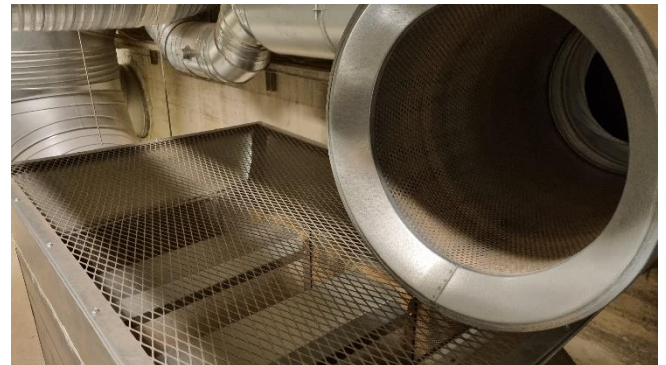
Kuva 148. Kierrätysilmakoneille otetaan ilmaa konehuoneesta 038. Ilmanottoaukoissa on pinnoittamatonta mineraalivillaa.
