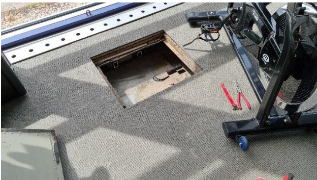
Kuva 86. Ikkunapuhalluksen tuloilmakanavat kulkevat välipohjarakenteen betonirakenteisessa kanaalissa.
