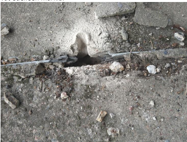
Kuva 100. Betonilaattojen välistä räystään alta tehdyssä avauksessa ei havaittu kosteuseristystä.
