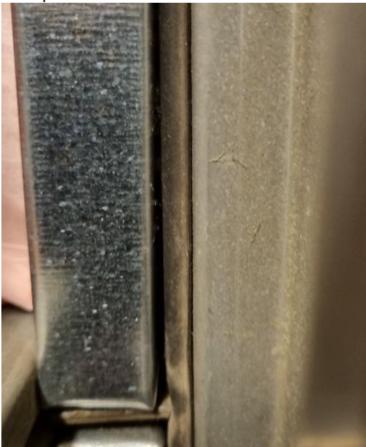
Kuva 154. Koneen TK6 suodattimet eivät asennu tiiviisti.
