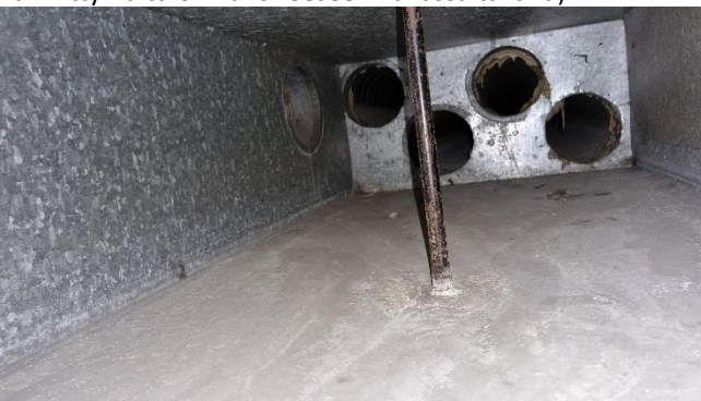
Kuva 158. Keilahallin lattian pöyinen ja likainen poistoilmakanava, josta otetaan kierrätysilmaa koneelle TK6.
