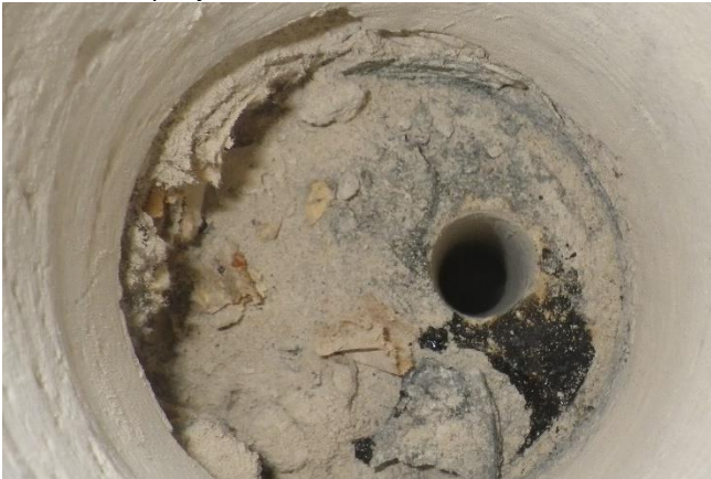
Kuva 50. Siivouskomeron 010 alapohjassa kulkee vanha patteriputkisto pohja- ja pintalaatan välissä (paperi kuvassa). Putken eristeessä ei havaittu asbestia ( HA.13 ), bitumisively sisälsi runsaasti PAH-yhdisteitä ( HA.12 ).
