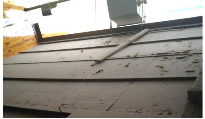
Kuva 89. Iäkkäiden akustiikkalevyjen päällä on runsaasti pölyä ja hapertuneista levyistä irtoaa helposti mineraalikuituja sisäilmaan.
