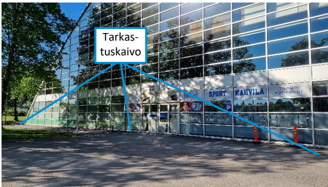
Kuva 14. Salaojan tarkastuskaivojen sijainnit koillisella seinustalla (keilahallin edusta).
