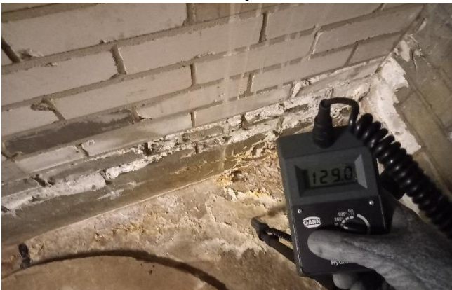
Kuva 24. IV-konehuoneen 001 lattian ja maanvastaisen seinän kosteusvaurioita, jotka pintakosteudenosoittimen perusteella olivat mittaushetkellä märkiä.
