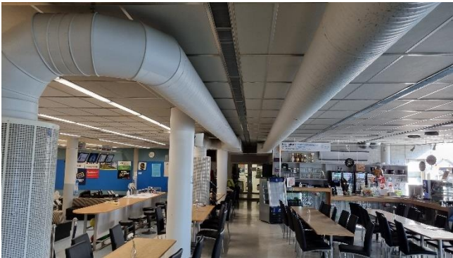
Kuva 129. Keilahallin kahviossa tuloilma jaetaan syrjäyttävän ilmanvaihdon päätelaitteiden kautta.
