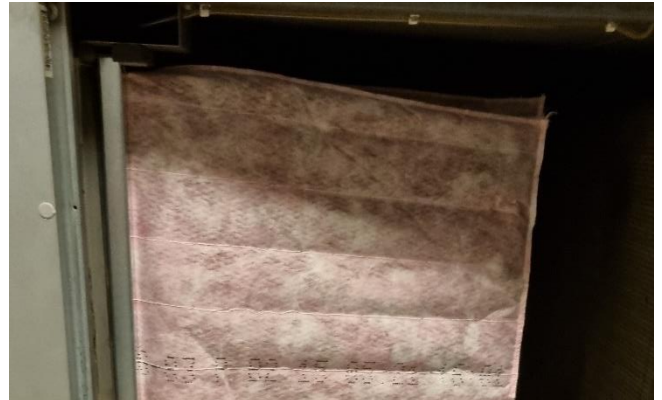
Kuva 161. Suodattimet eivät asennu tiiviisti.
