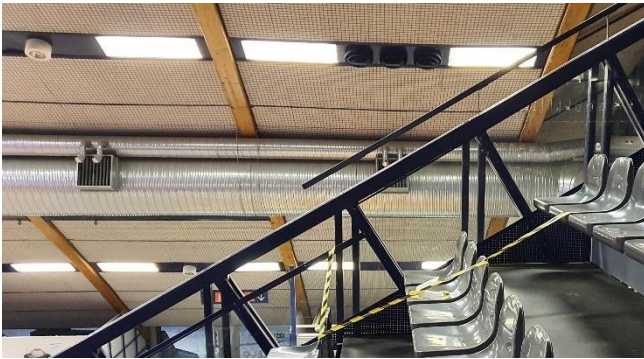
Kuva 139. Tuloilmakoneen TK2 ilmaa puhalletaan kenttäkerroksen päädyn kanavien kautta (paksumpi putki) ja kierrätysilmaan koneesta TK2 KOF1 ohuemman putken suuttimista.
