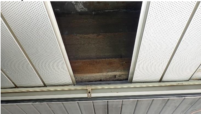
Kuva 115. Keilahallin keittiön sälekaton reikien kautta voi kulkeutua kuituja säleikön päällä olevasta mineraalivillasta.
