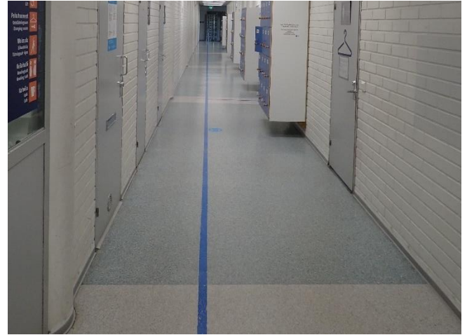
Kuva 19. Myös pukukoppikäytävän 090 ja kuntosaleille vievän käytävän 050 lattiassa havaittiin kosteuspoikkeamia.
