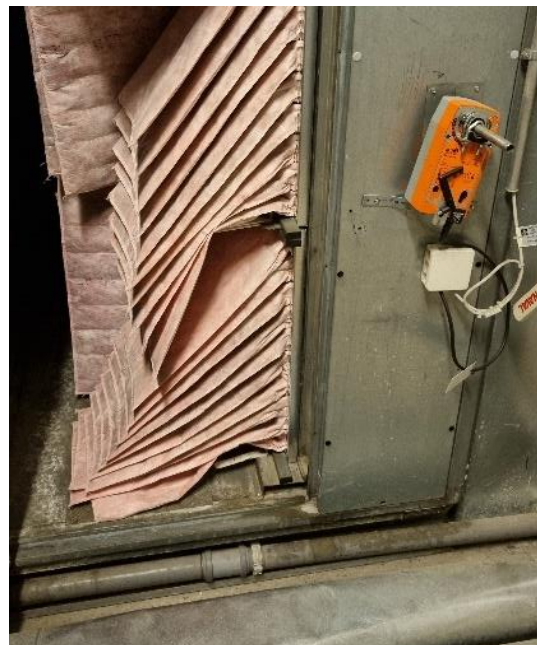
Kuva 155. Suodattimet pääsevät koskemaan kammion pohjaa. Kuvassa myös raitisilmapellin toimimaton moottori.
