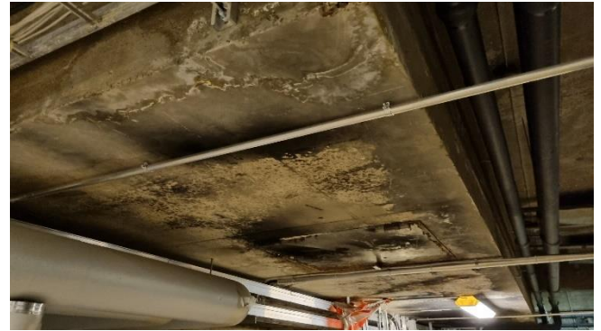
Kuva 103. IV-konehuoneen katon kosteusjälkiä.
