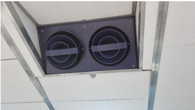
Kuva 168. Kierrätysilman puhalluksen päätelaite kuntosalin katossa.
