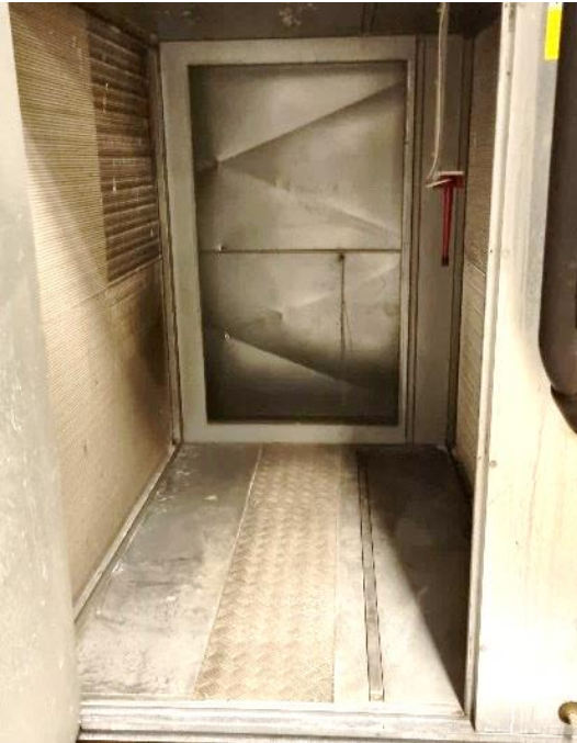
Kuva 156. Koneelle otetaan kierrätysilmaa poistokoneen TK6 PF1 kautta mm. keilahallin lattiasta (kierrätysilmakanavan liittymä tuloilmakoneeseen kuvassa takana).
