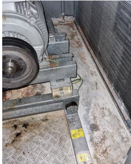
Kuva 157. Koneessa käytetään kostutinta, mikä näkyy runsaina kosteusjälkinä mm. puhallinkammiossa.
