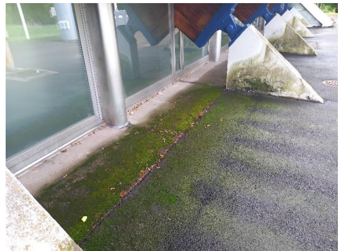
Kuva 99. Luoteispäädyn pihakannen kohdalla räystään alla on betonilaattoja.
