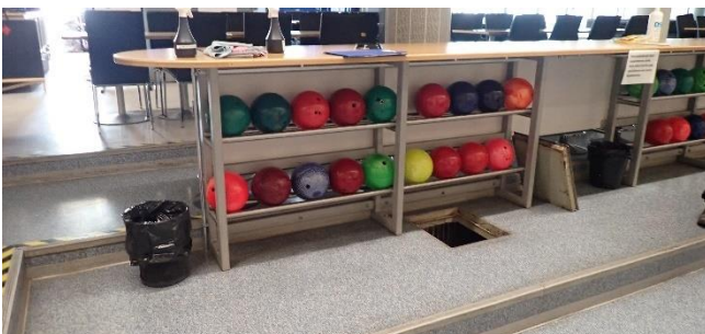
Kuva 60. Keilahallin katsomon alla kulkee betonikanaalissa peltinen poistoilmakanava, joka imee ilmaa keilaradan alta.
