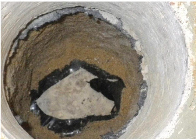
Kuva 35. Rakenneavauksesta R3 ampumaradan alapohjaan havaitaan pintalaatan ja kantavan laatan välissä kahden muovin välissä paksuhko (120 mm) hiekkakerros.
