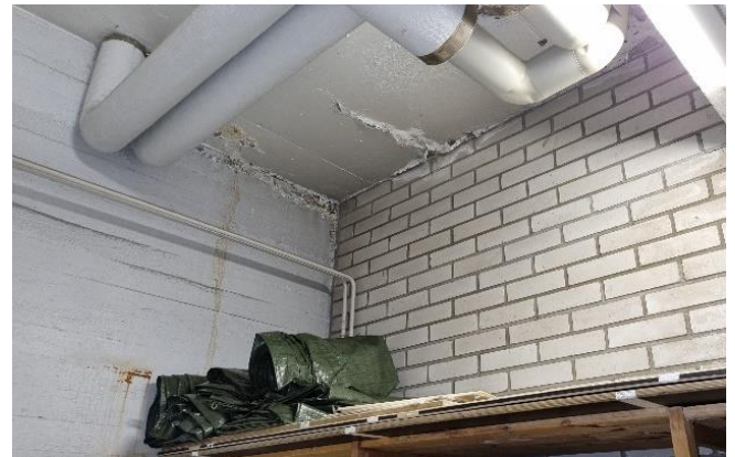
Kuva 25. Ampumaradan tauluvarastossa 005 pihakannen alle jäävän katonosan kosteusvaurioalue oli tutkimushetkellä märkä.
