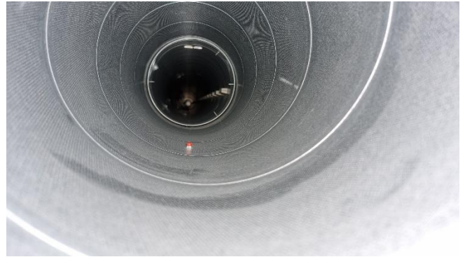
Kuva 126. Tuloilmakanavan pohjalla oli vähän hienojakoista pölyä.
