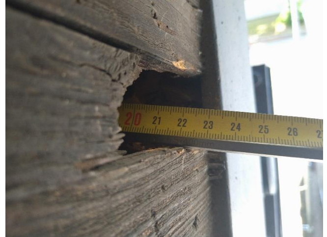
Kuva 95. Lahovaurio ulottuu koko palkin läpi.
