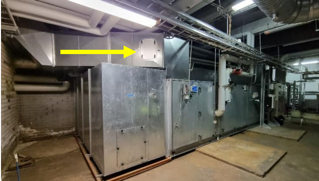
Kuva 131. Tuloilmakone TK2. Etualalla alhaalla raitisilmakammio, jonka päällä vinosti kenttäkerroksen lattiasäleikön kautta imettävän kierrätysilman kanava (keltainen nuoli).
