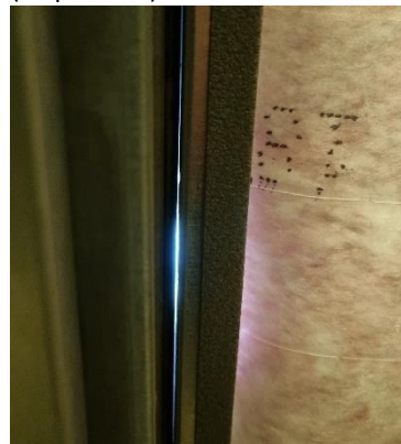
Kuva 124. Suodattimet ovat hyväkuntoiset, mutta eivät asennu tiiviisti.
