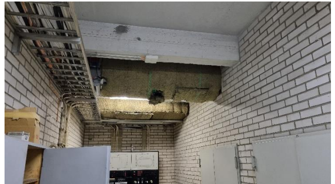
Kuva 118. Ampumaradan takakäytävillä tuloilmakanavien ympärillä oli pinnoittamatonta mineraalivillaa.
