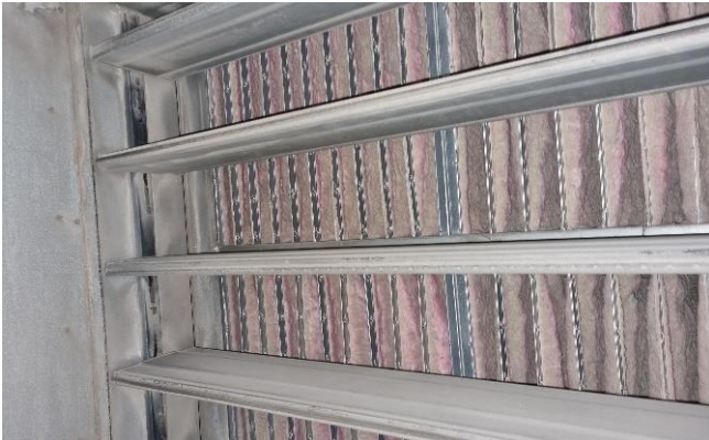
Kuva 160. Tuloilmakoneen TK7 raitisilmapelti ei sulkeudu koneen pysähtyessä.
