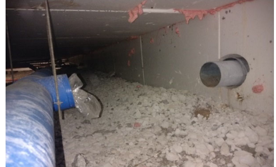
Kuva 3.6. Korvausilmakanavasta puuttui pala putkea.
