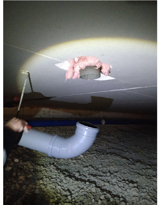
Kuva 1.6. Astianpesukoneen viemäriputken riipustus oli pettänyt. Korjaus aloitettiin vielä arviointikäynnin aikana.
