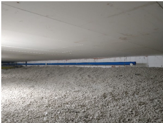
Kuva 3.3. Ryömintätilan korvausilma jaetaan putkistolla eri puolille tilaa. Tilan pohjalla oli kapillaarikatkona ja lämmöneristeenä kevytbetonimurskaa, joka oli aistinvaraisesti arvioituna kuivaa.
