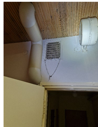
Kuva 8. Mm. käytävällä on alkuperäiset painovoimaisen ilmanvaihdon venttiilit.
