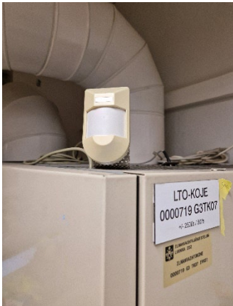
Kuva 5. Ilmanvaihtokoneen toimintaa normaalivirtauksen ja pienvirtauksen välillä ohjataan läsnäoloanturilla.
