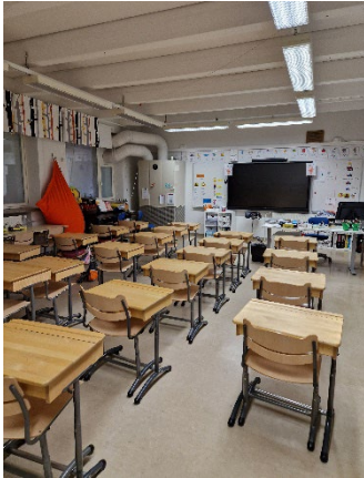
Kuva 3. Tutkituissa luokkahuoneissa on tilakohtaiset Swegon Compact Air ilmanvaihtokoneet.
