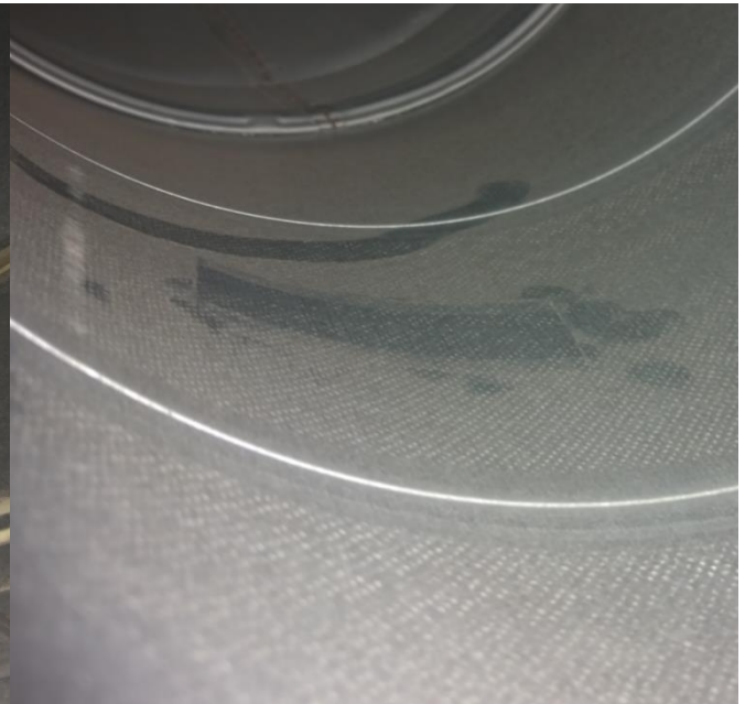
Kuva 5. Näytteenottoaikka KK4, kanavan pohjalla pölyä.
