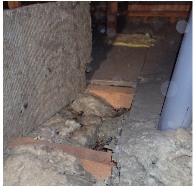
Kuva 40. Keittiön kohdalla kovalevyn alla oli jyrksijän jätöksiä. Kuvassa näkyvän muoviputken läheltä on otettu materiaalinäyte M39.
