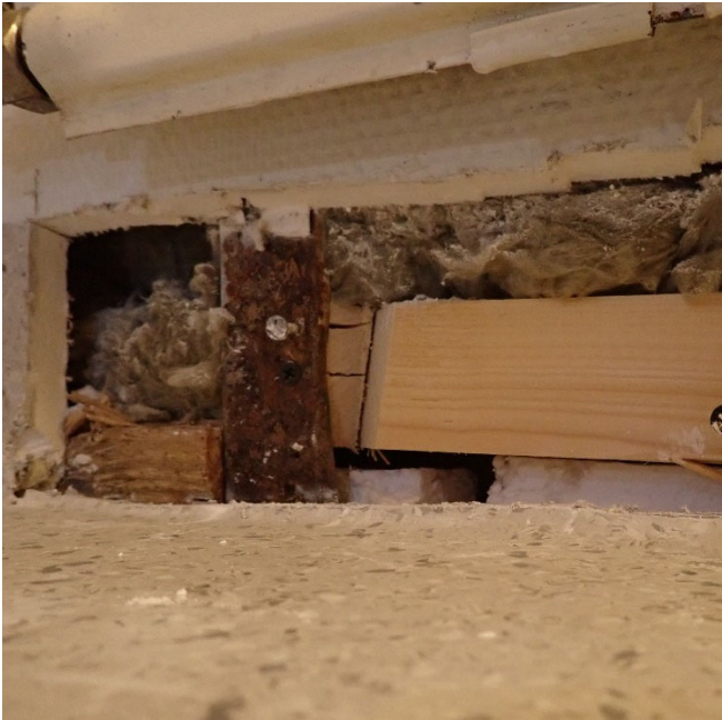
Kuva 35. Teräsranka (kuvassa pystyrunko) on väliseinien alaosissa paikoin ruostunut. Kuvan kohdassa (käytävä 33) väliseinä on äänieristetty ja sen alaosa lähtee alalaatalta. Seinää on korjattu, puun alta näkyy hieman eps-eristettä.
