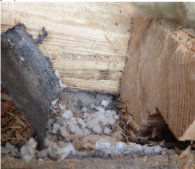
Kuva 25. Alaohjauspuun ja bitumikermin alta todettiin sokkelinhalkaisussa olevan EPS-eriste.
