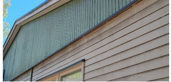
Kuva 13. Julkisivulaudoituksen takana on tuuletusrako ja yläosa tuulettuu jakopellin kautta.
