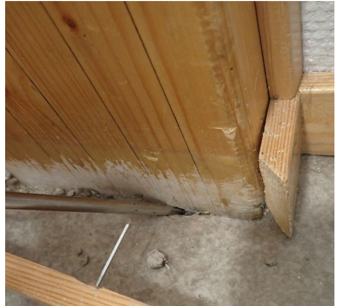
Kuva 28. Liimapuupilarin antura on noin lattiapinnan tasossa. Kuvassa ruuvimeisselin kärki on pilarin ja betonivalun välissä.
