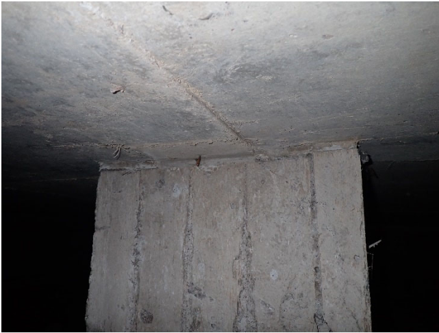
Kuva 18. Yksi pilariliittymä on jäänyt tiivistämättä
