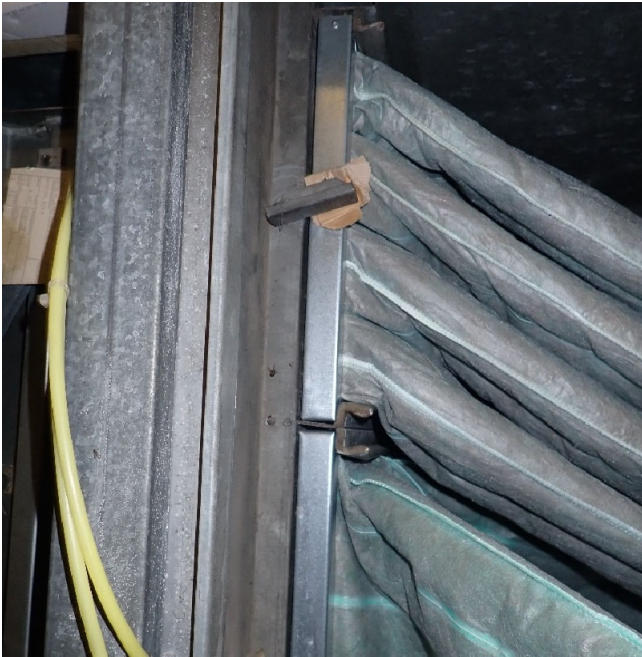
Kuva 50. Ilmanvaihtokoneen suodattimet ovat tiiviit ja koneen tarran mukaan vaihdettu noin 6 kk aiemmin tammi-kuussa.
