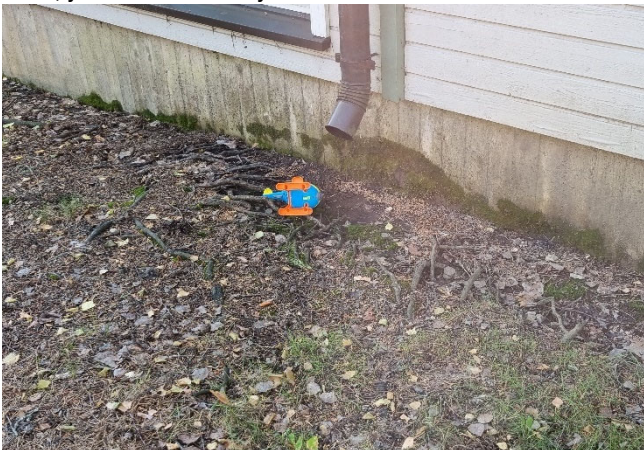
Kuva 10. Syöksytorvet ovat paikoin korkealla eikä sadevesiä ole jokaisen kohdalta ohjattu pois rakennuksen viereltä, tämä on lisännyt kosteusrasitusta sokkeliin.
