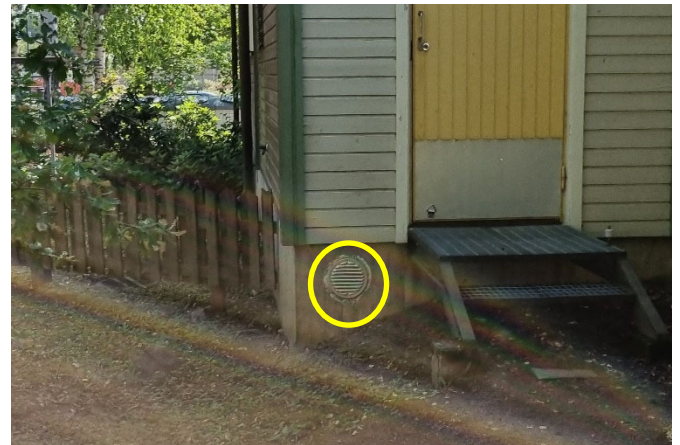
Kuva 11. Rakennuksen takana pohjoisen puolen seinustalla ilmanvaihtokonehuoneen kohdalla sokkelissa on tuuletusrilöitä. Rakenneleikkauskuvassa tällä kohdin on kuitenkin maanvarainen laatta
