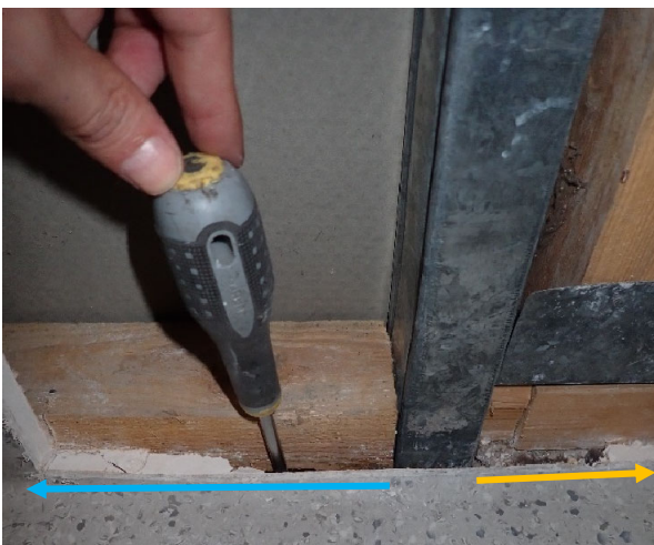
Kuva 33. Kuvassa näkyvässä rakenneavauksessa todettiin kahta eri väliseinätyyppiä. Pystyrangan vasemmalla puolella väliseinä alkaa alalaatalta (sininen nuoli), metallinen alajuoksu on kuvassa näkyvän puun alla. Pystyrangan oikealla puolella väliseinä alkaa pintalaatasta (oranssi nuoli) ja metalliranka on alaohjauspuun päällä.
