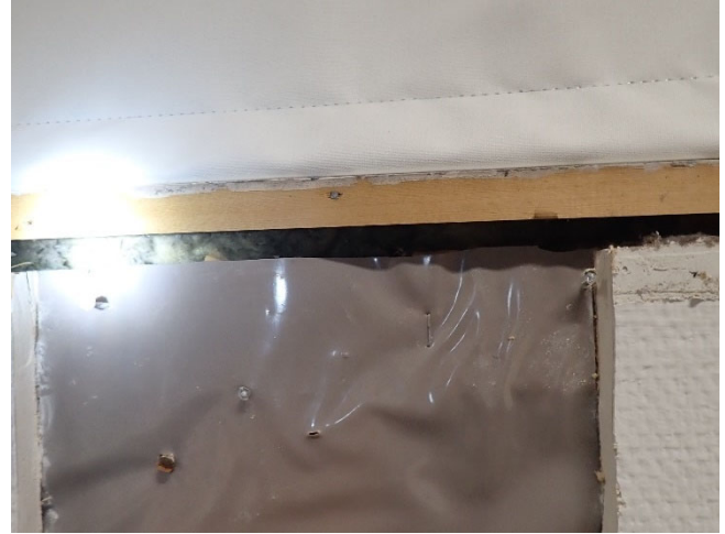
Kuva 30. Sisäverhouksen (kipsilevy) takana höyrynsulkumuovin asennus ikkunaliittymään on epätiivis.
