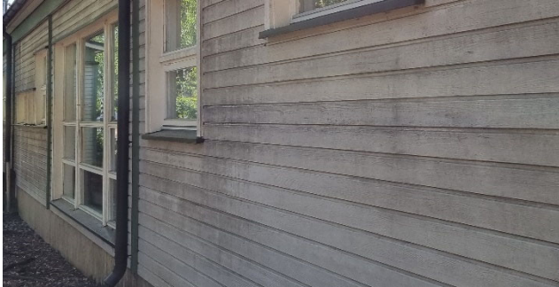
Kuva 12. Varjon puoleisella seinustalla julkisivun pinnassa on lievää tummentumaa.
