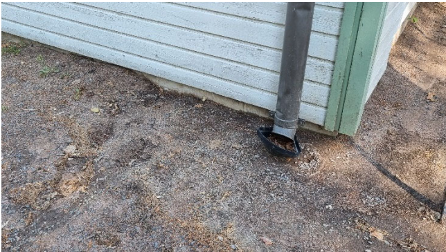
Kuva 8. Maan pinta on paikoin korkealla rakennuksen sokkelin vierellä. Kattovedet on ohjattu syöksytorvesta vesikäivoon, jossa on neulasia ja lehtiä.
