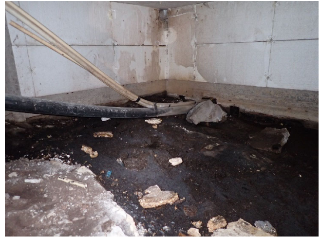
Kuva 19. Ryömintätilan nurkkaan kulkeutuu ajoittain vettä. Tarkasteluhetkellä maa oli kosteaa, mutta irtovettä ei ollut. Ryömintätilan seinät on lämmöneristetty EPS:llä.
