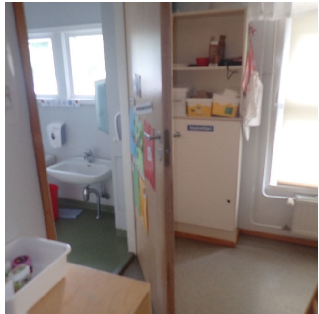
Kuva 21. Tilassa 68 olevassa kotelossa vesiputki kondensoi, mikä on aiheuttanut kosteusrasitusta kotelon rakenteeseen ja alapohjaan, myös tilan 65 puolella.
