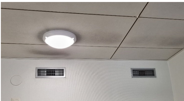
Kuva 4. Leikki- ja lepotiloissa kattoon liimattujen akustiikkalevyjen reunat ovat auki ja osa levyistä rikkinäisiä. Saadun tiedon mukaan on levyjen reunoille tehty kuitusidontakäsittely vuonna 2022.
