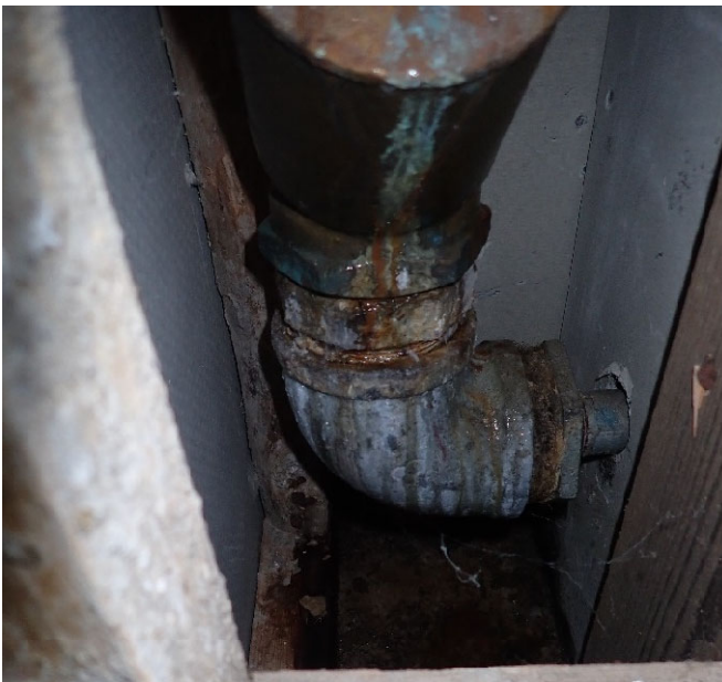
Kuva 14. Tilan 68 ulkoseinustalla olevassa kotelossa vesimittarilta tuleva putki kondensoi ja on aiheuttanut kosteusvauriota sekä kotelon rakenteeseen että alapohjaan.
