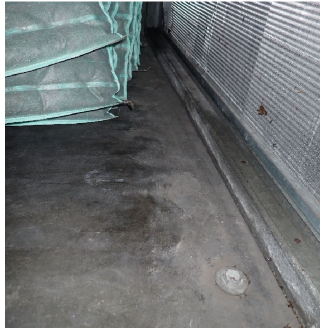
Kuva 51. Koneen kammion pohjalla oli vanhaa pinttynyttä likaa, mutta muuten kone on verrattain puhdas.
