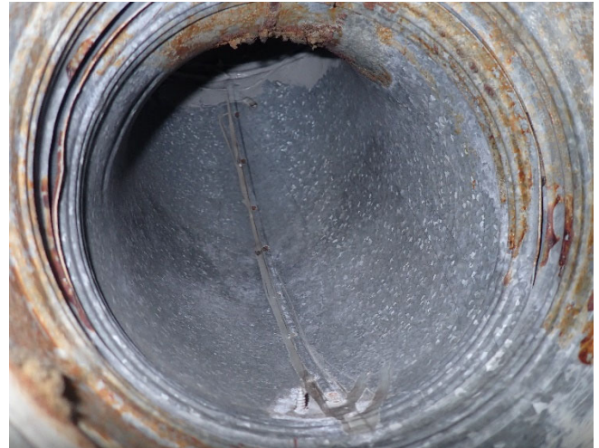
Kuva 49. Kanavassa oli paikoin korroosiota. Kanavat olivat pölyttömmät. Kuvan kohdasta on otettu kanavasta kuitumäärityksiin näyte KK1 .
