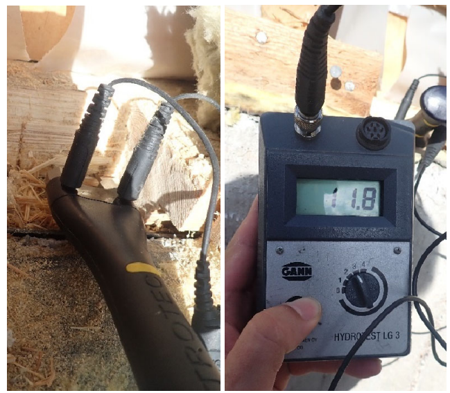
Kuva 26. Alaohjauspuun painokosteusprosentti mitattiin piikkimittarilla, tulos oli normaali.
