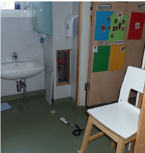
Kuva 20. Tilan 68 puolella sijaitsee kotelo, jossa oleva putki kondensoi.
