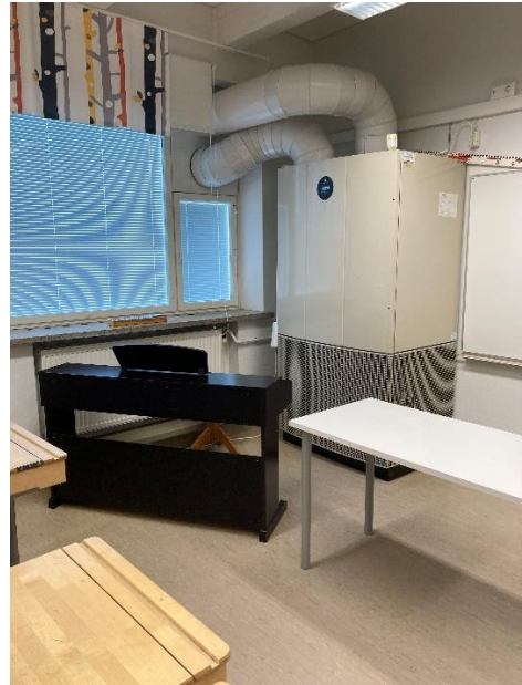
Kuva 2. Ilmanvaihtokoneen eteen oli sijoitettu kalusteita.
