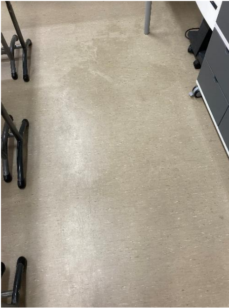
Kuva 1. Tutkittujen luokkien muovimattojen pinnat olivat kuluneita. Kuva luokasta 231.
