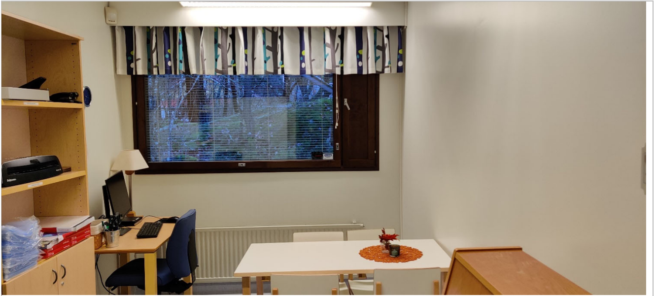
Kuva 2. Tilassa 138 oli selvä mikrobiperäinen haju, mutta näkyviä kosteusvaurioita ei havaittu. Viereisissä tiloissa hajua ei esiintynyt.
