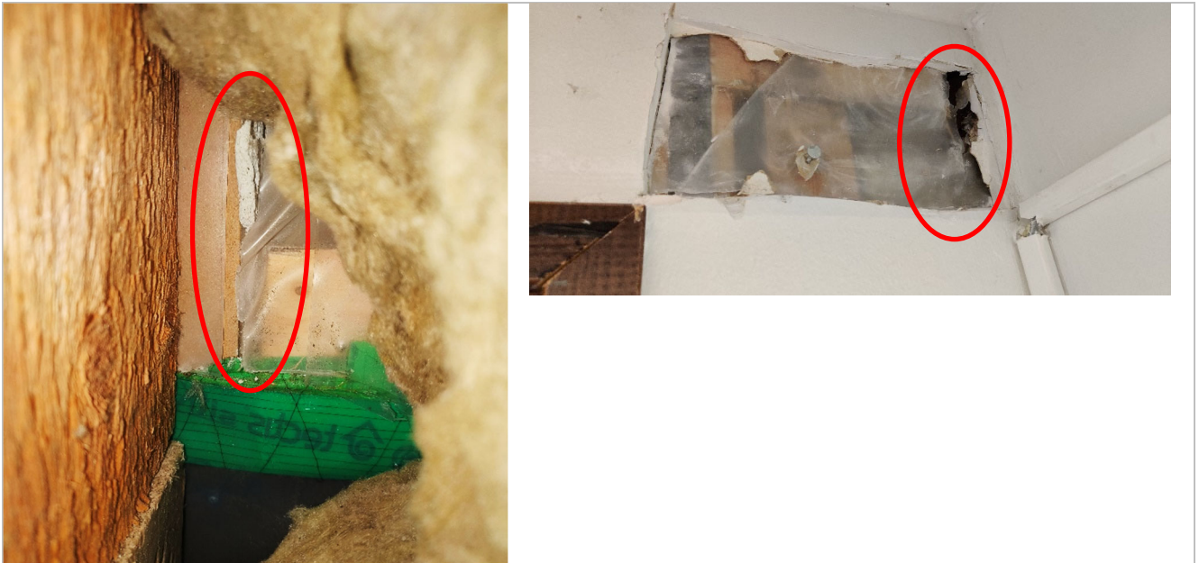
Kuva 12. Höyrinsuluissa on epätiiviyttä ulkonurkassa sekä seinän alaosassa (vasen kuva) että yläosassa (oikea kuva), mikä näkyi myös lämpökuvauksessa (vrt. kuvat 9-10)
