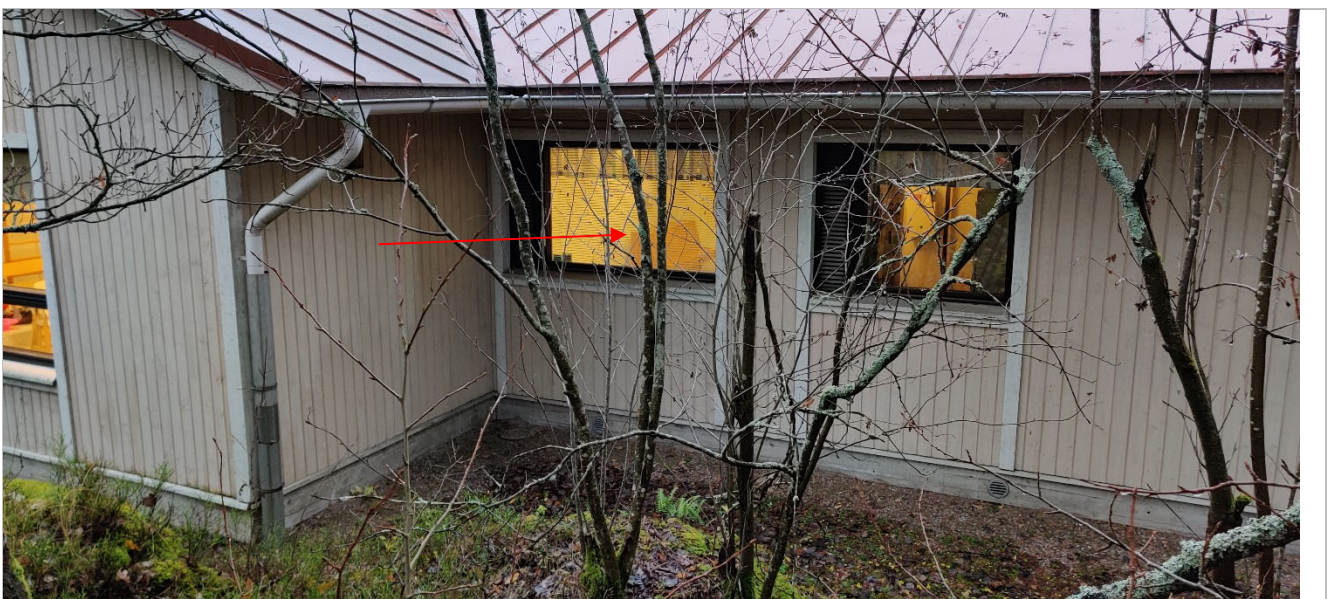
Kuva 3. Hajuongelmainen huone (nuoli) sijaitsee kalliorinteen puolella. Rakennuksen ympärille on asennettu patolevyt ja salaojitus, hulevedet johdetaan suoraan kaivoihin.
