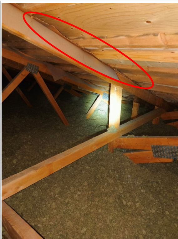
Kuva 17. Vesikate ja kattoruoteet on jossain vaiheessa uusittu, jolloin ruoteiden päälle on asennettu vaneri aluskatteeksi. Vanha aluskatepahvi on poistettu alakautta, jolloin pahvi on jäänyt vanhan kattotuolin ja uusien kattoruoteiden väliin (punainen alue). Lämmöneristeenä on puhallusvillaa, jonka alla on levyvilla.
