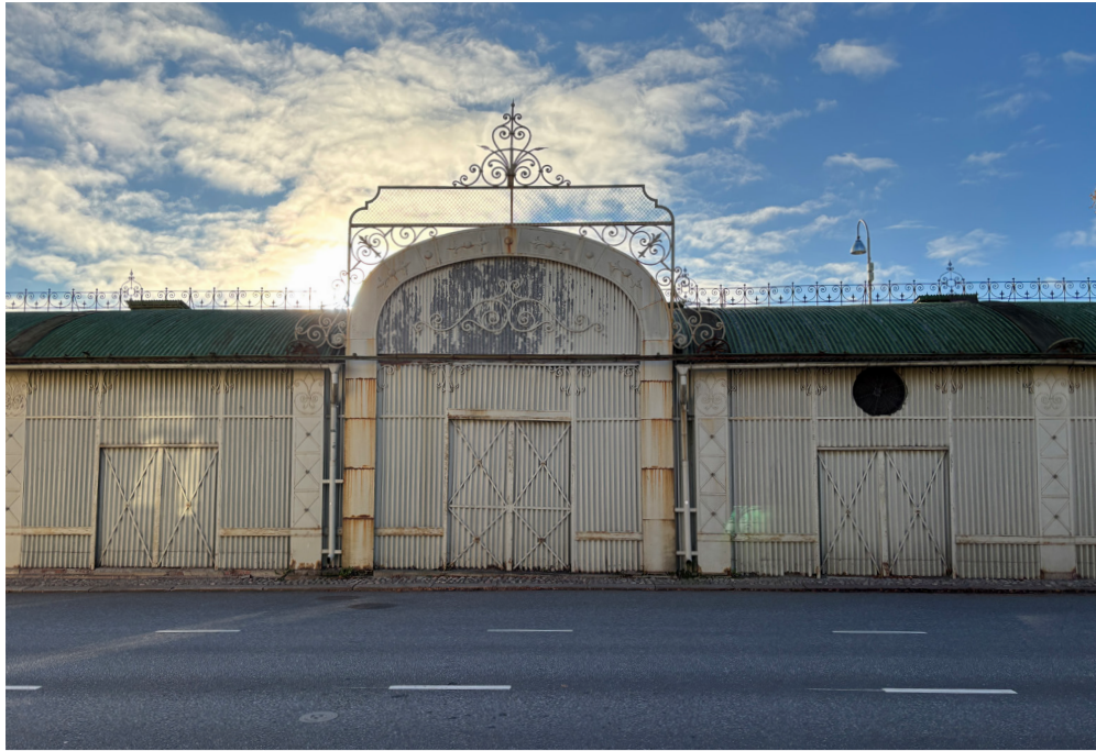
2. Julkisivu Linnankadulle on silynyt pitkälti alkuperäisenä. Julkisivuun on puhkottu iv-laitteiden läpivientejä, ilmeisesti kun varasto-osaan rakennettiin ravintola vuonna 1997.
