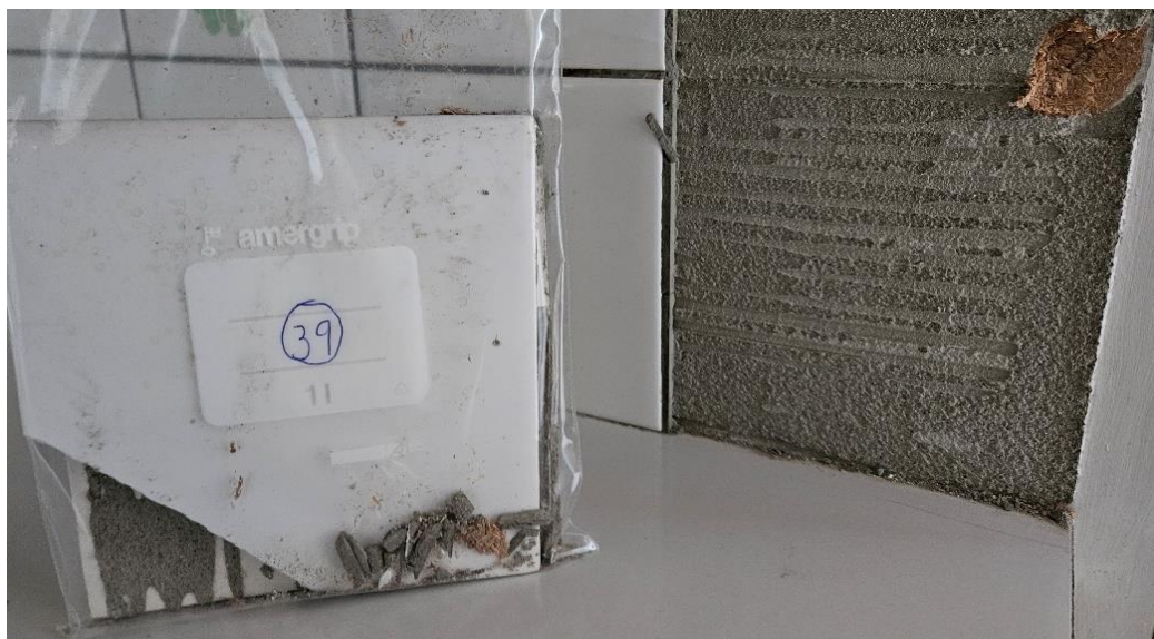
Kuva 11. Asuinosan keittiön välitilan laattojen kiinnityslaasti ( näyte 39 ) sisältää asbestia.
