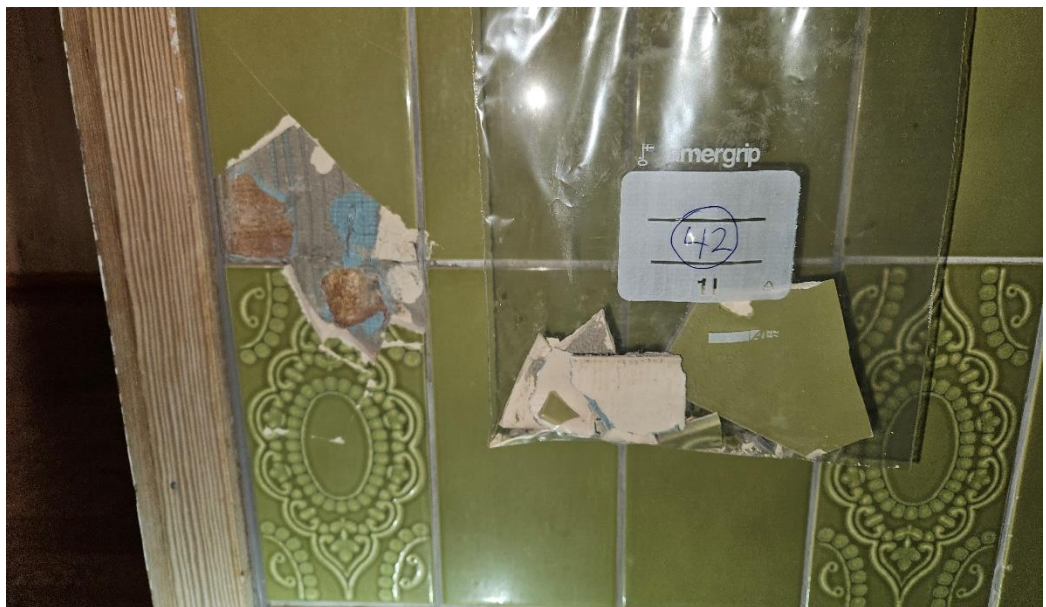
Kuva 14. Asuinosan suihkutilan vihreän seinälaatan takana oleva sininen muovimatto ( näyte 42 ) sisältää asbestia.
