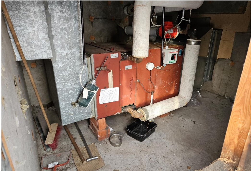
Kuva 15. Vesikatolla oleva iv-konehuone. Konehuoneessa on asbestipitoisia putkieristeitä.
