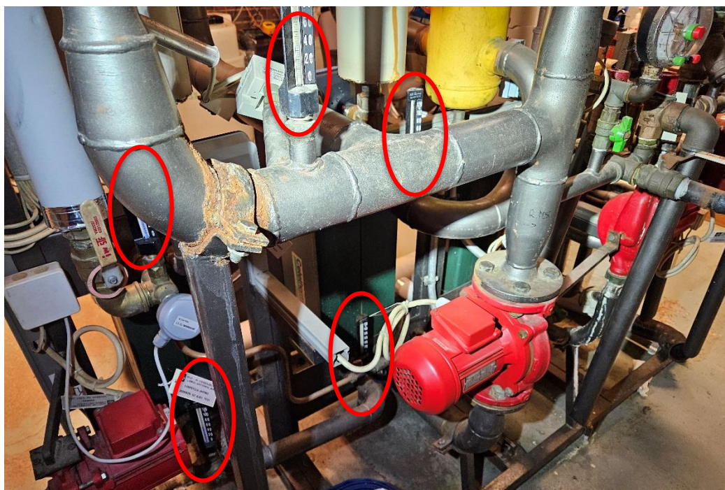
Kuva 47. Lämmönjakohuoneessa on elohopeamittareita n.10 kpl. Mittarit merkitty punaisella ovaalilla.
