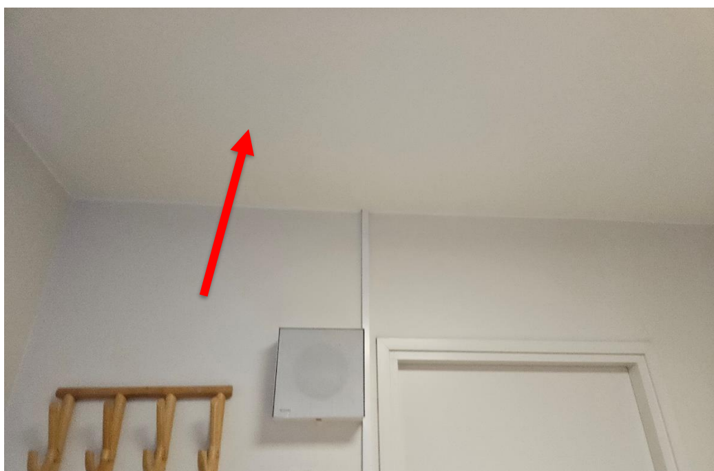
Kuva 42. Kellarikerroksen kattotasoiitteet + maalit ( näyte 32 ) eivät sisällä asbestia.
