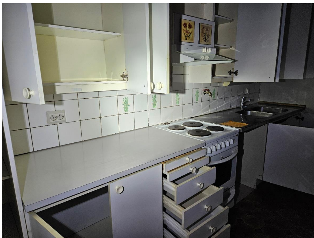
Kuva 12. Asuinosan keittiön välitilan laattojen kiinnityslaasti sisältää asbestia .
