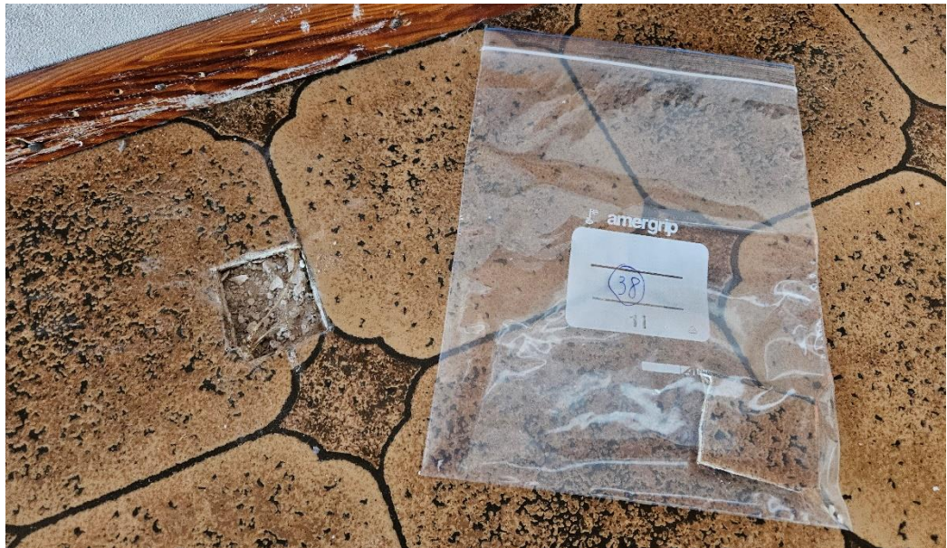
Kuva 45. Laattakuvioitu muovimatto + keltainen liima + harmaa karvalankamatto + liima + tasoite ( näyte 38 ) eivät sisällä asbestia.
