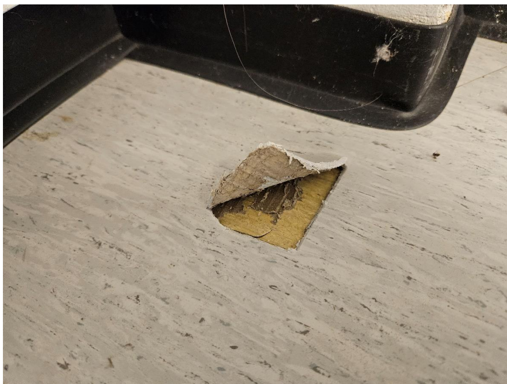
Kuva 2. Tumman vihreää muovimattoa on nykyisten pinnoitteiden alla. Tumman vihreä muovimatto sisältää asbestia.
