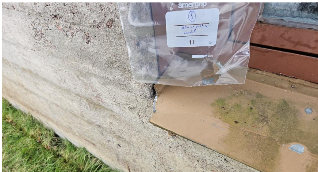
Kuva 22. Ikkunoiden vesipellitysten maalit ( näyte 5 ) eivät sisällä asbestia
