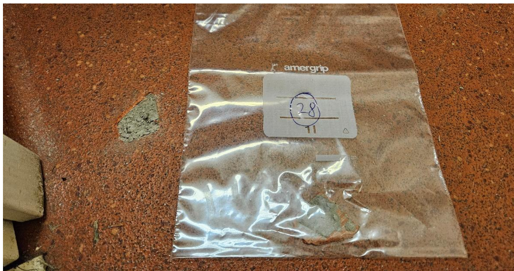
Kuva 38. Punainen muovimatto + liima + tasoite ( näyte 28 ) eivät sisällä asbestia.
