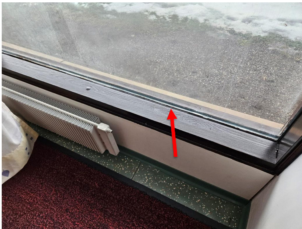
Kuva 48. Ikkunoiden lämpölaselementtien tiivisteet voivat sisältää PCB:tä.
