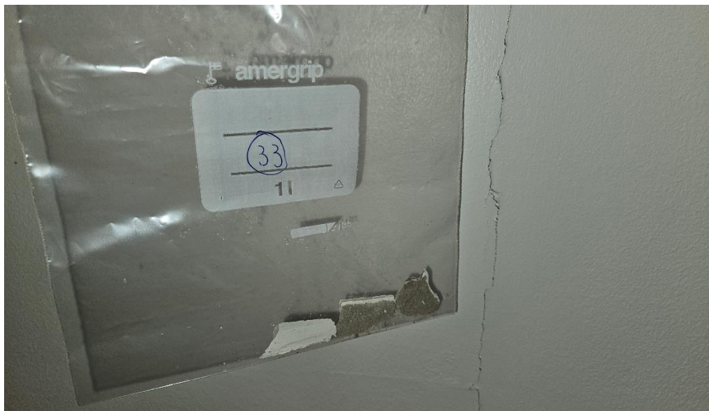
Kuva 7. Kellarin harmaa seinätasoiite (näyte 33) sisältää asbestia.
