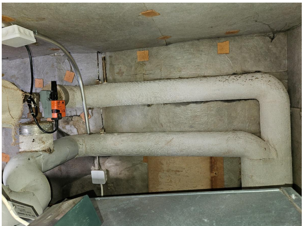
Kuva 16. Asbestipitoisia putkieristeitä vesikatons iv-konehuoneessa.
