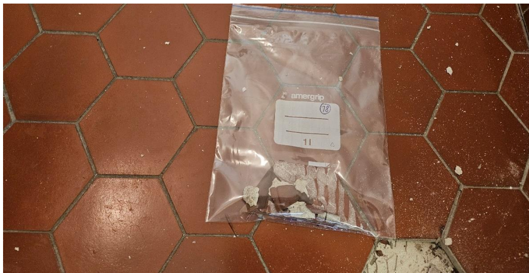
Kuva 5. Kuusikulmalaattojen harmaa kiinnityslaasti/tasoite (näyte 18) sisältävät asbestia.
