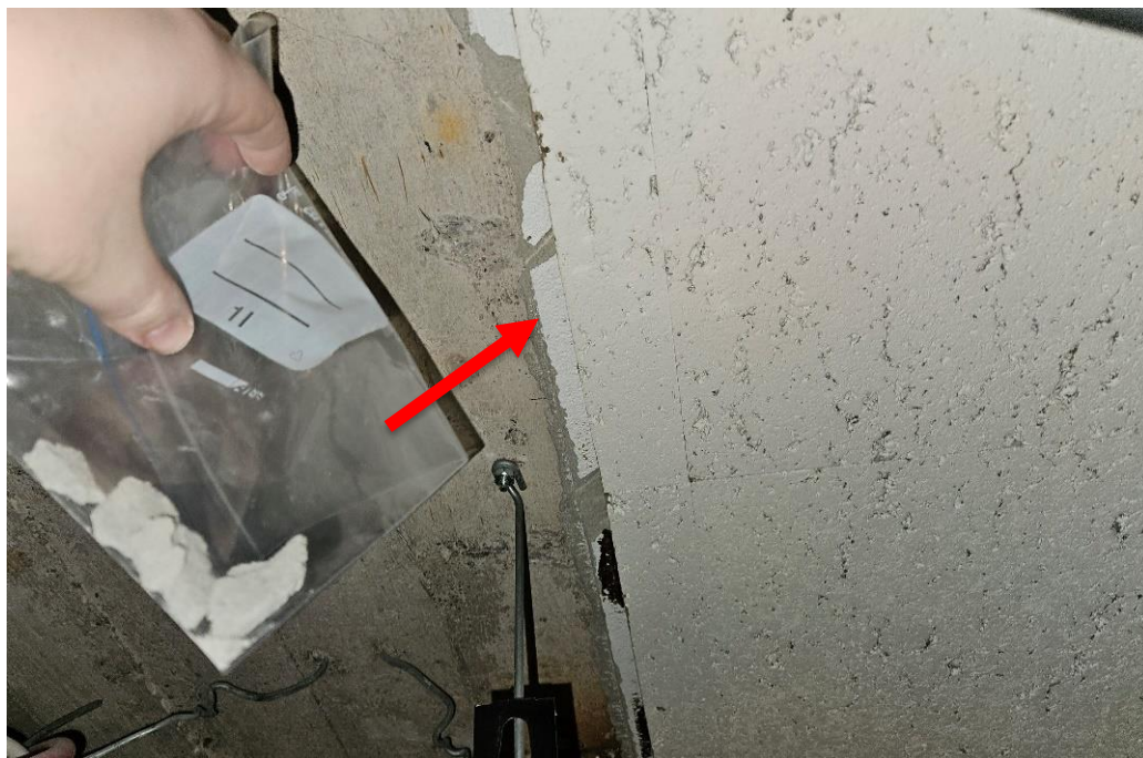
Kuva 10. Ensimmäisen kerroksen alakattolevyjen takana oleva tasoite ja maali (näyte 35) sisältävät asbestia.
