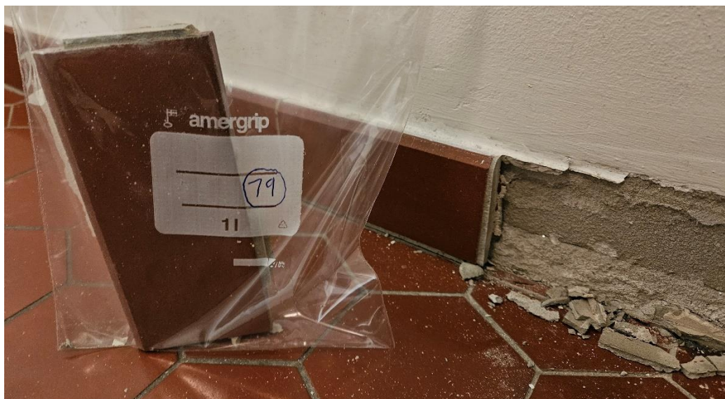
Kuva 8. Punainen ylösnostolaatta, harmaa saumalaasti ja vaaleanharmaa kiinnityslaasti/ta-soite ( näyte 19 ). Asbesti on vaalean harmaassa tasoitteessa / kiinnitysaineessa.
