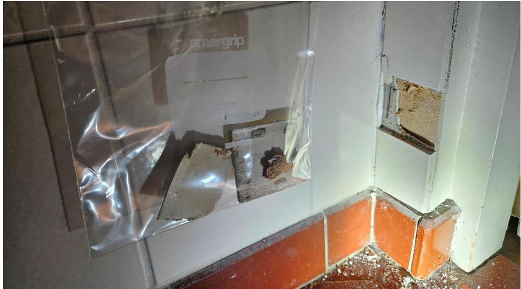
Kuva 13. Asuinosan wc:n laatan takana oleva sininen muovimatto ( näyte 40 ) sisältää asbestia.
