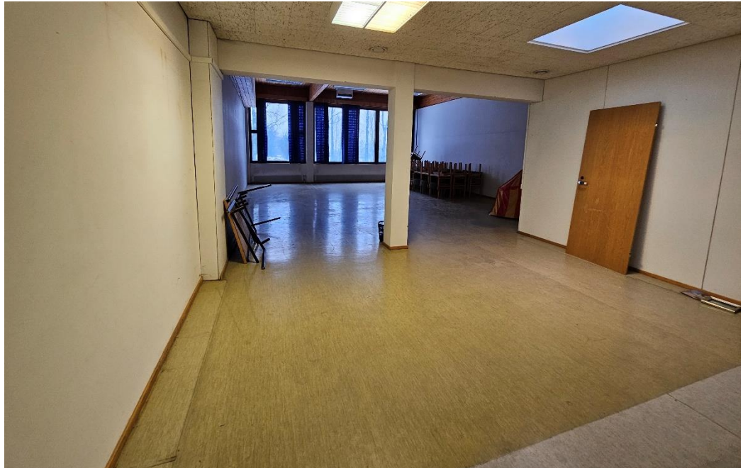
Kuva 3. Tumman vihreää muovimattoa. Sisältää asbestia.
