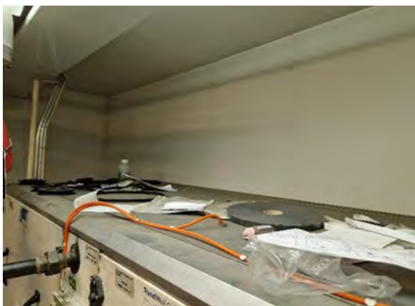
Kuva 184. Ilmanvaihtokoneen päälle on kerääntynyt epäpuhtauksia.
