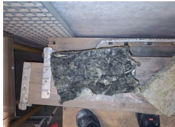
Kuva 126. VP2, välipohjan alapinnan tummunut mineraalivilla.
