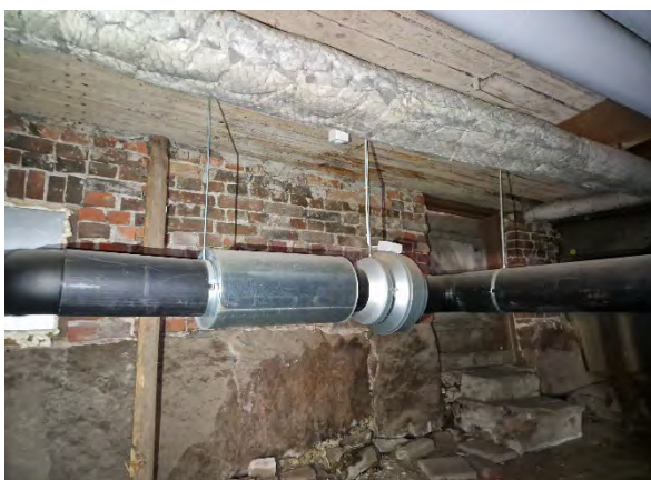
Kuva 20. Vanhempien osien alapohjatiloihin on toteutettu koneellinen poistoilmanvaihto.
