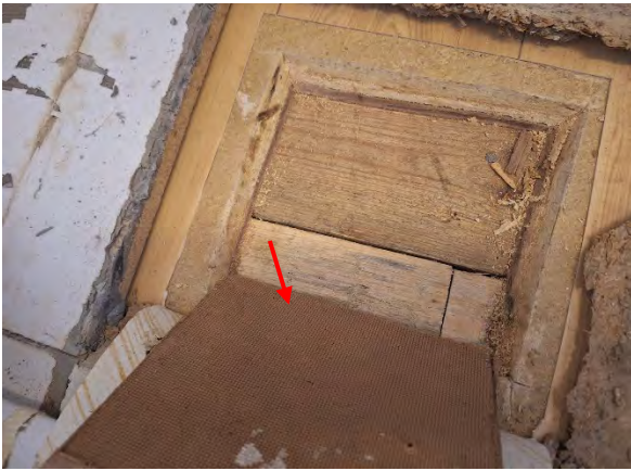
Kuva 38. AP4, kovalevyn alta havaittiin lattialankku.
