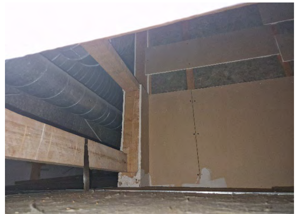
Kuva 140. Laajennusosan väliseinärakenteet ovat lämmöneristeiden suhteen avoimia alakattojen yläpuolella.
