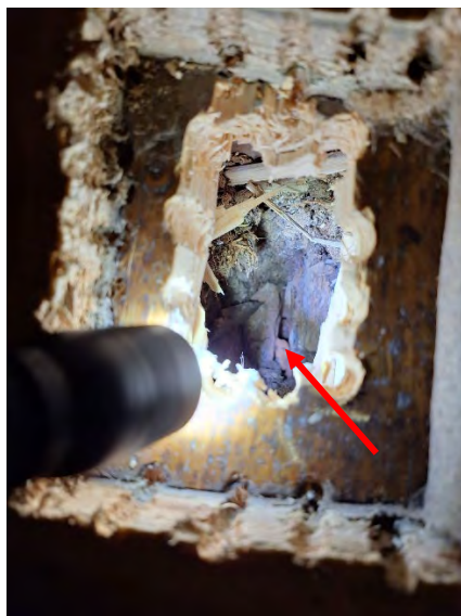
Kuva 52. AP7, alkuperäisen lankkulattian alla sahanpurua sekä turve-/sammaleriste. Eristekerroksen alla tiiliholvi, jonka tiilien samoista puuttui muurauslaasti (punainen nuoli).
