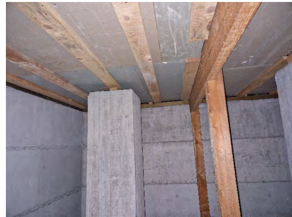
Kuva 134. Välipohjan reuna-alueilla on paikoin avoimia rakoja lämmöneristetilaan.
