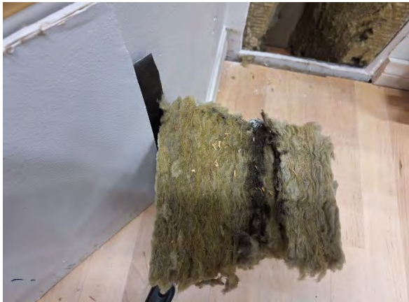
Kuva 79. Rakenneavaus US3, mineraalivilla paikoin tummunut.
