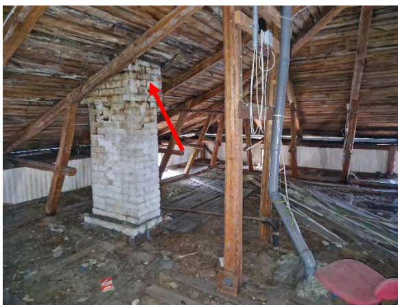
Kuva 154. Vanhoja vuotojälkiä savuhormin ympärillä. Tuuletusviemäriputket ovat lämmöneristämättömiä yläpohjatilassa.
