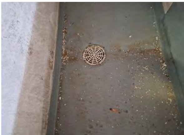
Kuva 186. B- ja C-osan raitisilmakammio on likainen ja lattiakaivossa on lehtiä.
