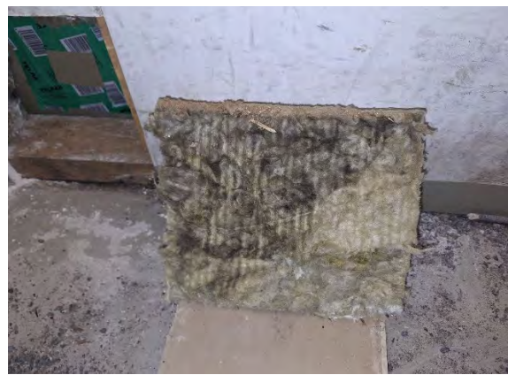
Kuva 82. US4, mineraalivillan ulkopinnassa tummentumaa.
