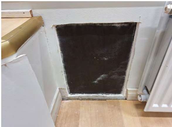
Kuva 77. Rakenneavaus US3, kipsilevyn takana ilmansulkupaperi.
