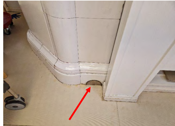
Kuva 3. Alapohjarakennetta on korotettu ja takan nuohousluukku on jäänyt nykyisen lattiarakenteen kohdalle.
