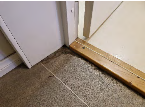
Kuva 6. Varatienä toimivan sisäänkäynnin kynnyksen kohdalla on paikallinen pesuvesistä johtuva kosteusjälki.
