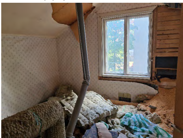
Kuva 158. Vanhempien rakennusten yläpohjatilassa on aiemmin asuinkäytössä olleita huonetiloja. Haitta-ainekartoituksen perusteella kuvassa olevassa tilassa voi
