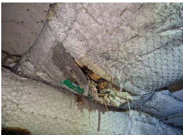
Kuva 18. Vesijohdon kohdalla olevaa kosteusjälkeä, putki on osin lämmöneristämätön.
