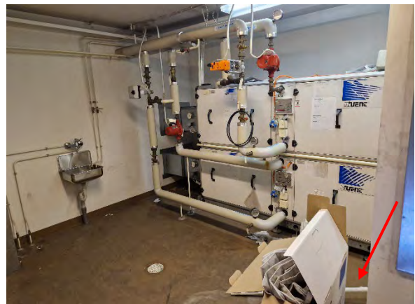
Kuva 123. Toisen ilmanvaihtokonehuoneen lattiarakenteen kaadot ovat osin puutteelliset kaivon päin.
