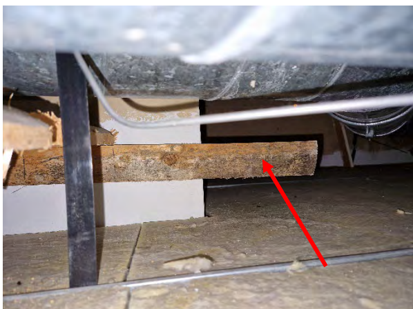
Kuva 163. Alakattorakenteiden puutavarassa on muutamien paikoin näkyvää mikrobikasvustoa.
