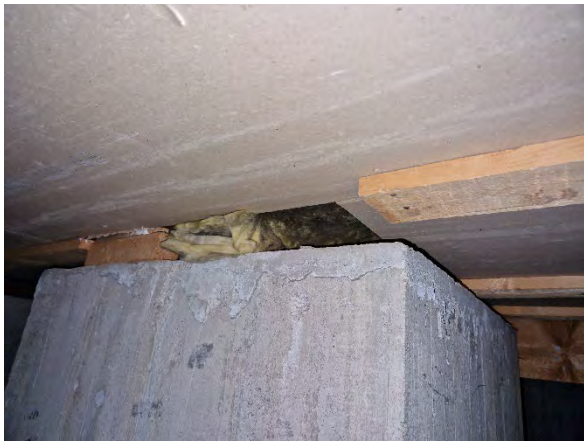
Kuva 133. Laajennusosan katon kannatuspilarin alaosan rakenne on avoin lämmöneristeeseen.
