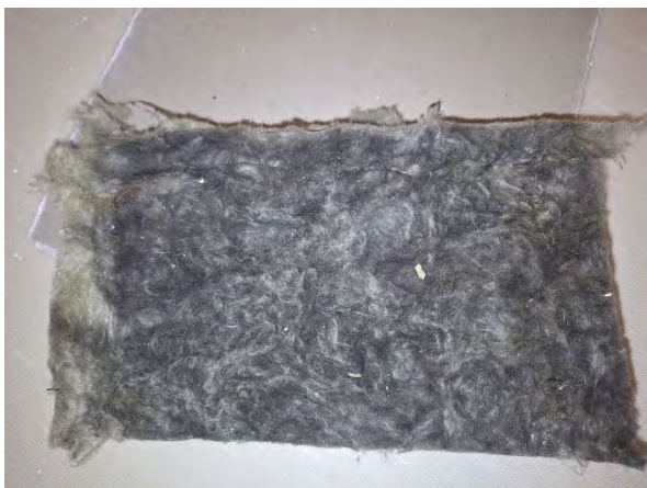
Kuva 92. US6, mineraalivillan ulkoseinän puoleisessa osassa havaittiin voimakasta tummentumaa.
