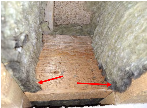
Kuva 125. VP2, välipohjan alapinnassa oleva mineraalivilla on selkeästi tummunut.
