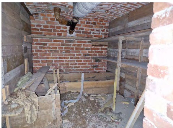
Kuva 12. Vanhempien osien alapohjan läpiviennit ovat yleisesti tiivistämättömiä.
