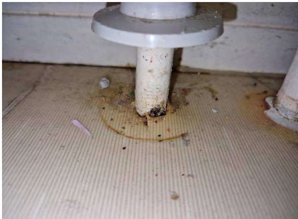
Kuva 8. Vanhempien osien alapohjan läpiviennit ovat yleisesti tiivistämättömiä.
