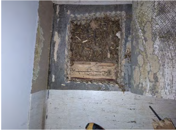
Kuva 43. AP5, lankkulattian alla havaittiin poikkihirsi sekä eristekerros.
