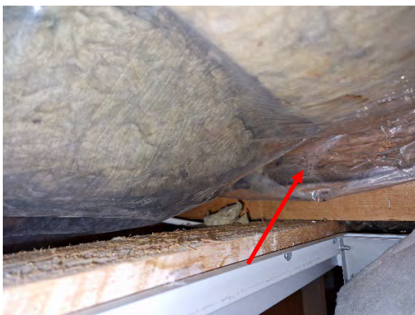
Kuva 164. Laajennusosan ja vanhemman rakennuksen käytävällä aiemman vesivuotokohdan läheisyydessä olevissa puurakenteissa on kosteuden aiheuttamaa tummentumaa. Höyrynsulkuna toimivaa muovikalvoa ei ole liitetty rakenteisiin tiiviisti, paikoin on näkyvissä avointa mineraalivillaa.
