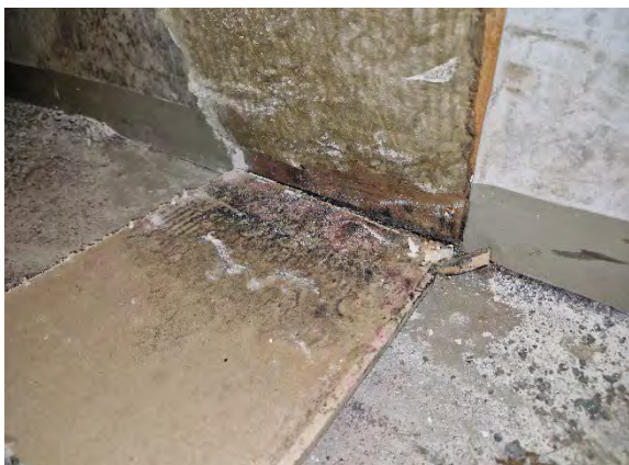
Kuva 81. US4, kipsilevyn taustapinnan mikrobikasvustoa.
