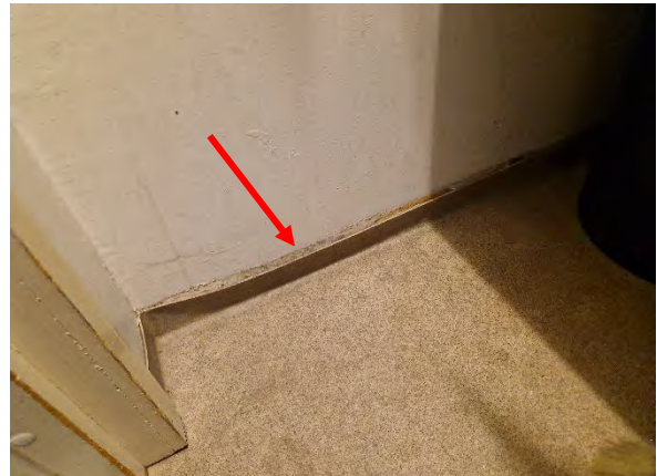
Kuva 7. Siivouskomeron lattiamaton ylösnosto on osin irronnut liimauksestaan.
