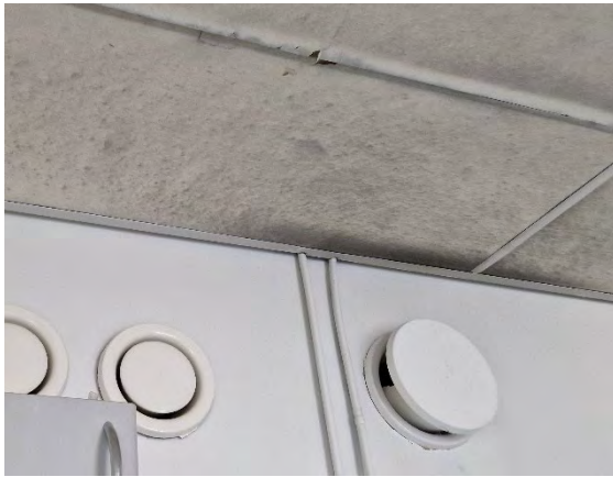
Kuva 190. Seinustan tuloilmapäätelaite on lautasventtiili ja ilman ohjaus on ylöspäin. Poistopäätelaitteet vieressä. Katossa on mahdollisia kuitulähteitä.
