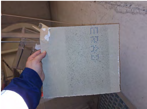
Kuva 127. VP2, välipohjan kipsilevyssä havaittiin mikrobikasvustoon viittaavaa tummentumaa.
