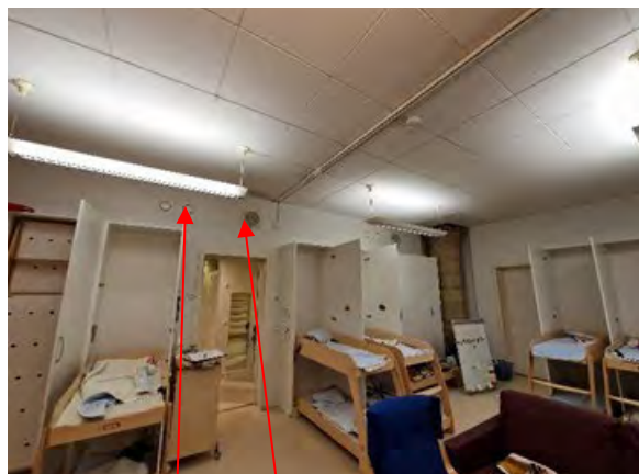
Kuva 189. Poisto- ja tuloilmapäätelaitteet on asennettu samalle seinustalle.
