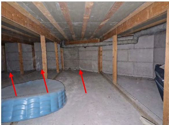
Kuva 62. Laajennusosan sokkelin sisäpuolisia kalkkihärmealueita.
