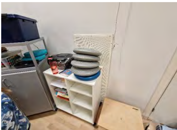
Kuva 188. Syrjäyttävän tuloilmasäleiköjen eteen oli asetettu kaappia yms. muuta tavaraa.
