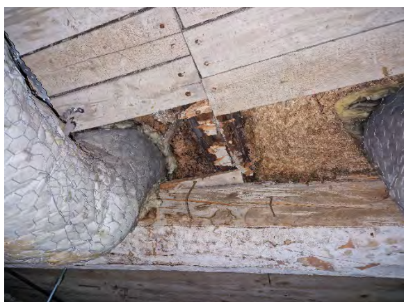
Kuva 15. Läpiviennin vierellä olevaa kosteusjälkeä ja alkanutta lahovauriota.
