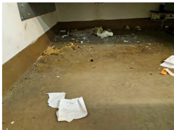
Kuva 185. Ilmanvaihtokoneen lattia on roskainen.
