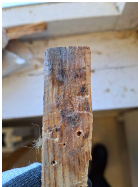
Kuva 105. IKK2, peitelistan alaosassa havaittiin rakenteen joskus kostuneen.
