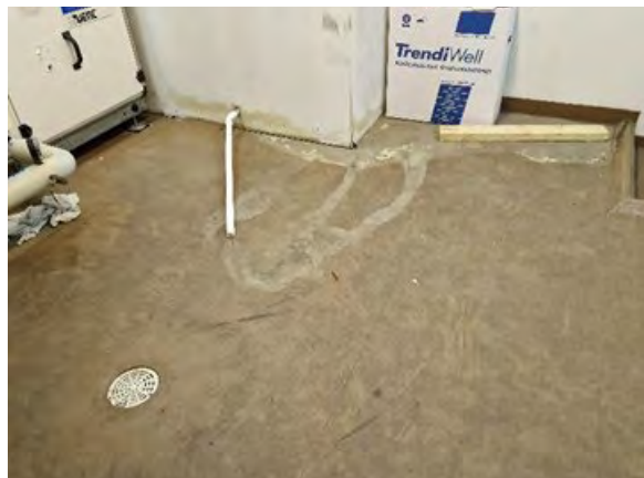
Kuva 187. Siitepölyn perusteella raitisilmakammioista johdettu kosteus jää makaamaan seinän viereen lattialle.
