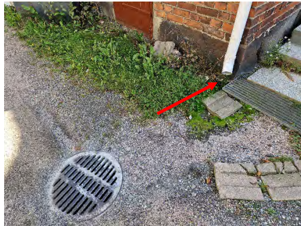
Kuva 177. Keittiön sisäänkäynnin vieressä sadevesikaivo. Sadevedet ohjautuu suoraan rakennuksen seinustalle.
