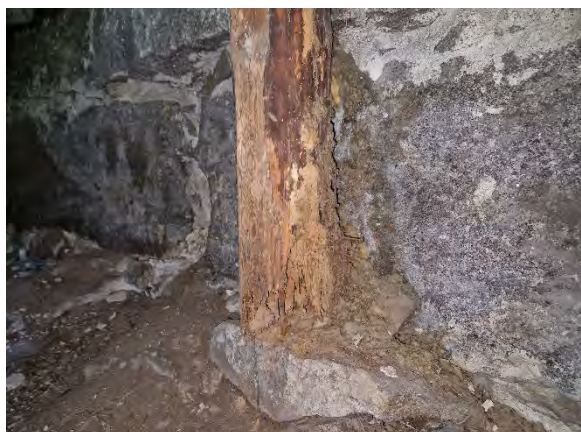
Kuva 19. Alapohjan laho- ja hyönteisvaurioitunut pystytukihirsi.
