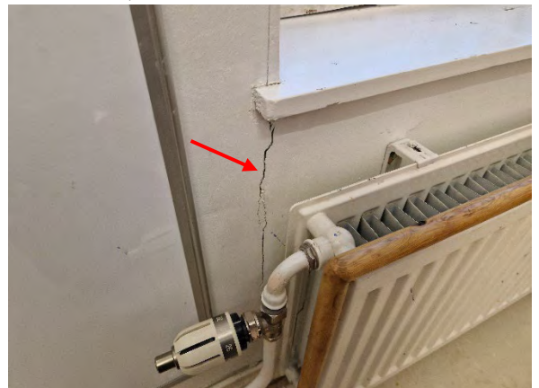
Kuva 63. Käsityöläiskadusta kauempana olevan rakennuksen pohjoispäädyn ryhmätilan ulkoseinässä on halkeilua.
