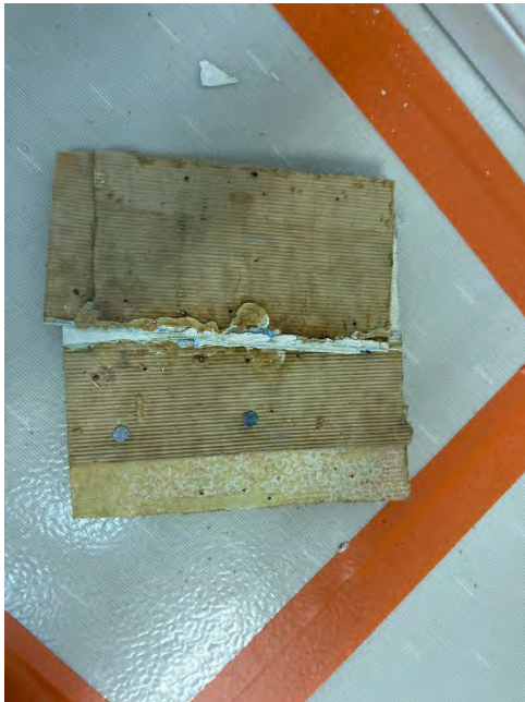
Kuva 96. US7. Tapetissa havaittiin kosteusvauriojälkiä.
