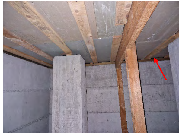
Kuva 121. Laajennusosan välipohjan kipsilevytyt on reunasta avoin ja lämmöneristevillat ovat näkyvissä.
