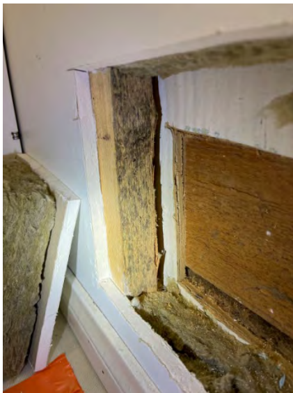
Kuva 94. US7, sisäpuolisessa koolauksessa havaittiin tummentumaa.
