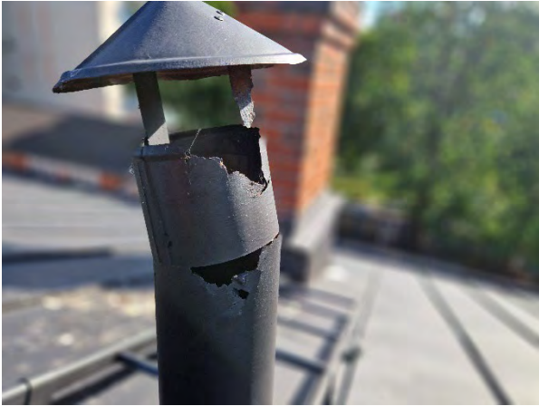
Kuva 171. Toisen vanhemman rakennuksen yksittäinen tuuletusviemärin suojapellitys on ruostunut puhki.
