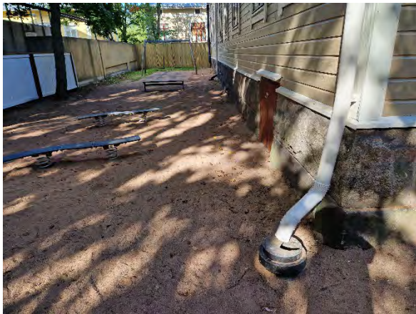
Kuva 178. Osa sadevesistä ohjataan sadevesijärjestelmään loiskekuppien kautta. Leikkialueen syöksytorvi ei ohjaudu loiskekupin aukkoon.
