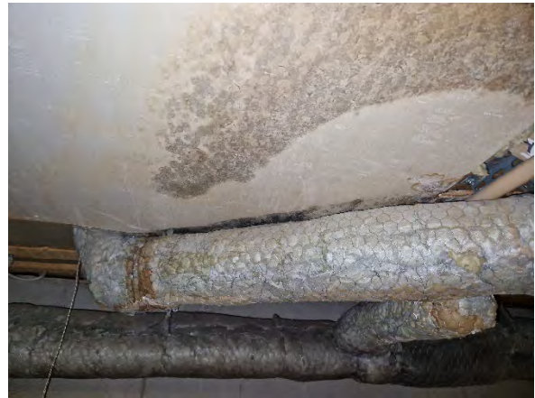
Kuva 119. Keittiön alapuolisen välipohjan mikrobikasvustoa.
