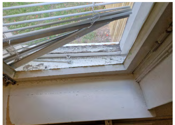
Kuva 65. Vanhempien rakennusten ikkunoiden vaurioita.
