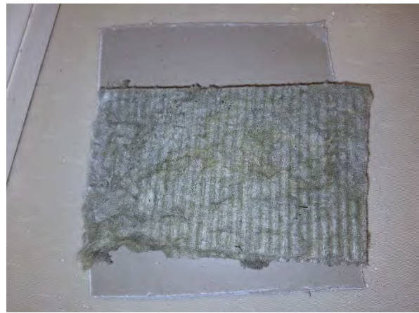
Kuva 91. US6, mineraalivillan sisäpuolinen osa.
