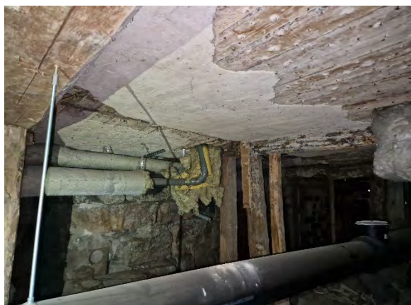
Kuva 13. Alapohjan alapinnassa on vähäisesti paikoillaan ohut rappauserros, muualla rappaus on pudonnut tai pudotettu.
