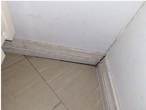
Kuva 150. Rakenneavausta VS1 ympäröivässä seinän ja lattian liitoksessa huomattava rako.
