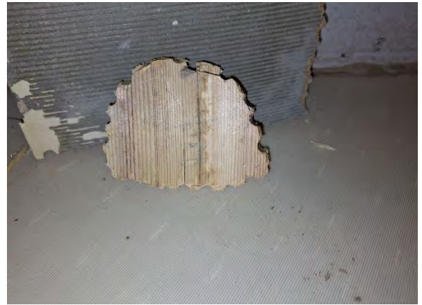
Kuva 46. AP6, lattialankku, jossa havaittiin kosteusvauriota.
