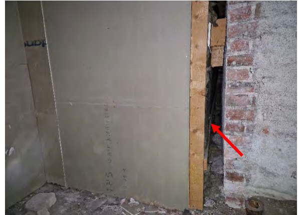
Kuva 144. Lastenvaunuvaraston väliseinärakennetta alustatilassa. Väliseinään ei ole asennettu tuulensuojalevyä tiilimuurausta vasten olevalle osuudelle, lämmöneriste näkyvissä.
