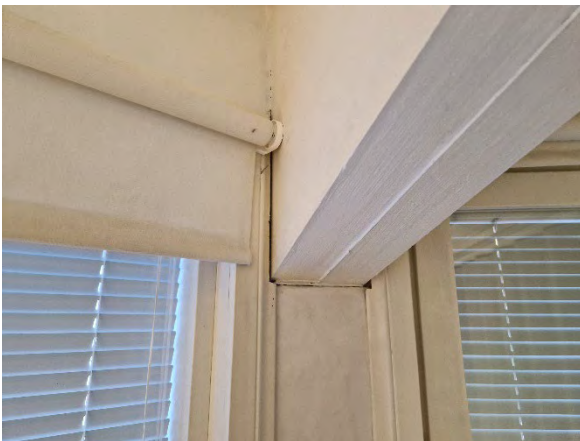
Kuva 112. Laajennusosan kattopalkkien ympäristät ovat tiivistämättömiä.
