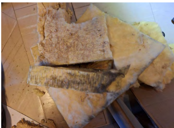
Kuva 49. Rakenneseavaus AP7, mineraalivilla paikoin tummentunut.
