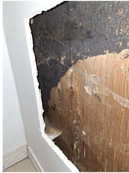
Kuva 147. VS1, alkuperäisessä hirsirungossa osittain kiinni vanha bitumihuopa, jossa voimakas ratapölkyn haju.
