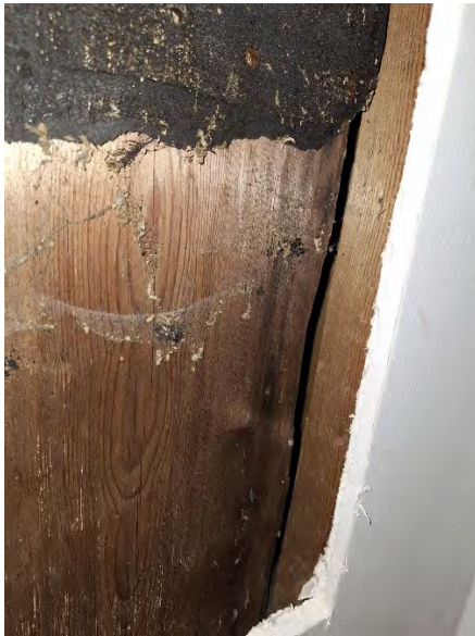
Kuva 146. VS1, klipsilevyn takana puukoolaus sekä alkuperäinen hirsirunko sekä reilu ilmarako.
