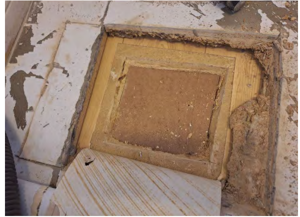
Kuva 37. AP4, lankkua muistuttavan muovimaton alla lastulevy sekä pahvi/kovalevy.
