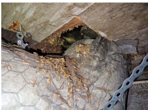
Kuva 14. Vanhempien osien alapohjan läpiviennit ovat yleisesti tiivistämättömiä.
