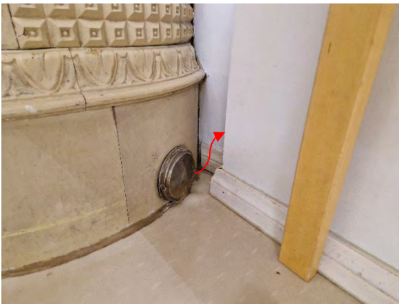
Kuva 53. Takkojen ympärillä esiintyy aistinvaraisesti havaittavaa ilmapuottoa.
