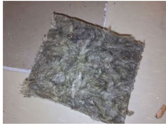
Kuva 100. IKK1, ulkoseinän mineraalivillan ulkoseinän puoleisella puolella havaittiin tummentumaa.
