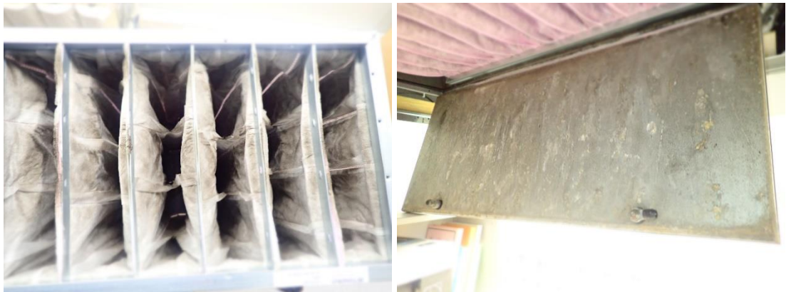
Kuvat 312 ja 313. Yleiskuvat tuloilmakoneen suodattimesta ja suodatin osan pohjana toimivasta huoltoluukusta. Huoltoluukussa on runsaasti vanhoja kosteusjälkiä.
