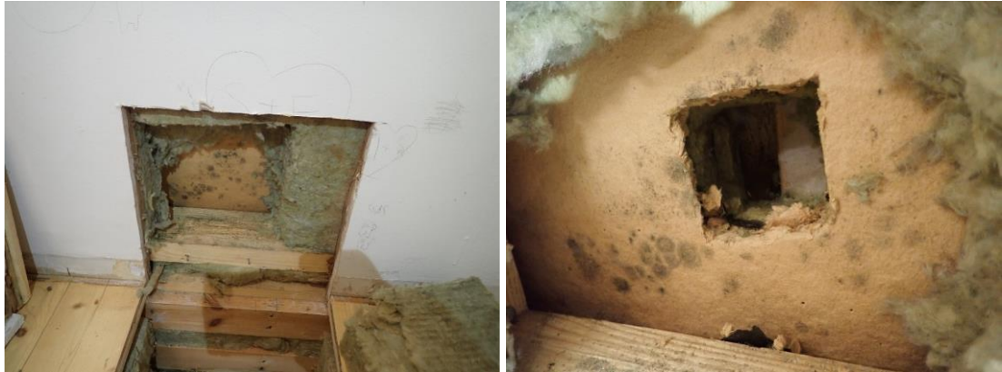
Kuvat 106 ja 107. Rakennusaukko R5 US tehtiin B-osan kuvaamataidon luokan ulkoseinän alaosaan. Rakennusaukosta otettiin näytteet N4 (mineraalivilla) ja N5 (huokoinen puukuitulevy) mikrobianalyysiin. Mineraalivillassa ei esiintynyt mikrobikasvustoa. Huokoisessa puukuitulevyssä esiintyy sienikasvustoa.
