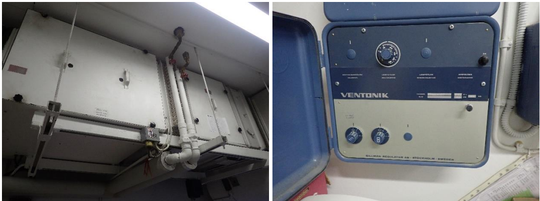
Kuvat 293 ja 294. Yleiskuvat tuloilmakoneesta ja sitä ohjaavasta yksikkösäätimestä.
