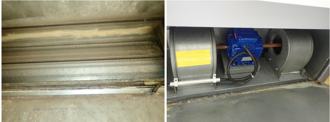
Kuvat 314 ja 315. Yleiskuvat ulkoilmapellistä ja tuloilmapuhaltimista. Ulkoilmapeltti ei sulkeudu täysin kiinni asennossa.
