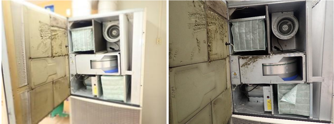
Kuvat 331 ja 332. Yleiskuvat paikallisista ilmanvaihtokoneista TK11 ja TK18. Koneet ovat sisäosiltaan silmämääräisesti hyväkuntoisia. Koneiden ilmamääräasetus oli käyttöpaneelin asetuksen perusteella n. \pm 230 l/s (tilojen alkuperäiset suunnittelu-arvot tulo- ja poistoilmavirtauksille ovat \pm 150 l/s).
