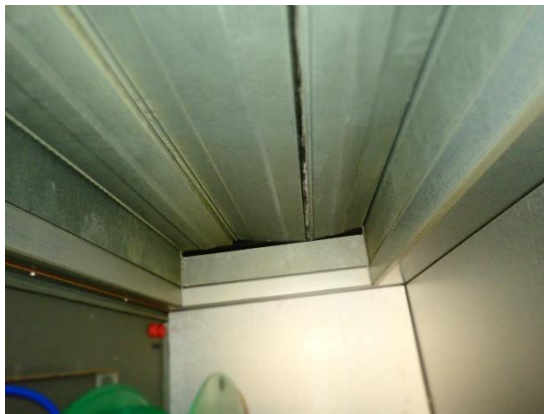
Kuvat 330. Yleiskuvat jäteilmapelistä, joka ei sulkeudu täysin kiinniasennossa. Ulkoilmapelti sulkeutui täysin kiinniasennossa.
