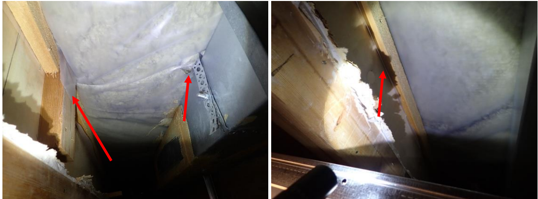
Kuvat 252 ja 253. (AK20). Keittiötilassa yläpohjan höyrynsulkumuovin ilmatiiveys on rakenneliittymien ja läpivientien osalta erittäin huono.
