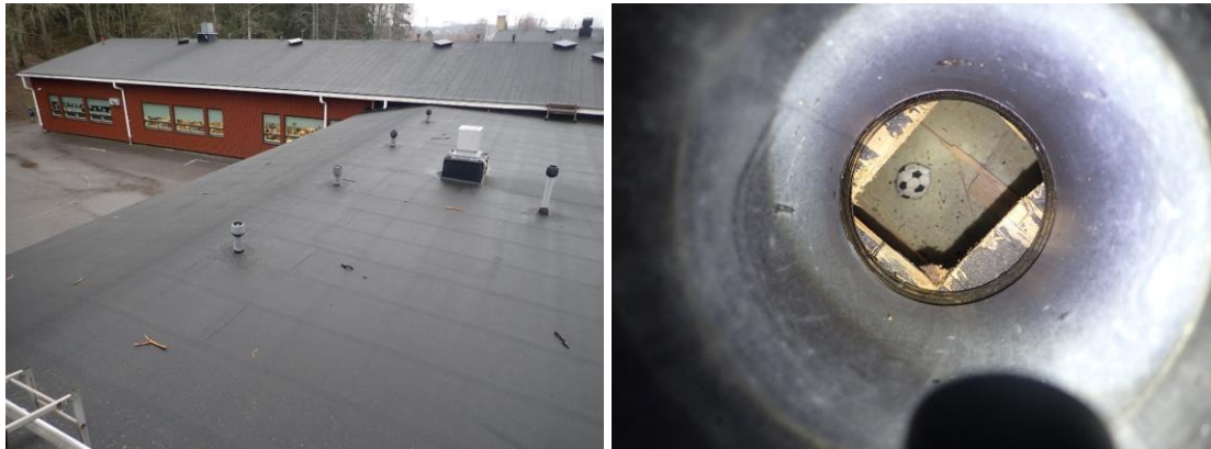
Kuvat 167 ja 168. Yleiskuva A-osan vesikatoilta opettajienhuoneen kohdalta. Bitumikermikate on asennettu vuoden 2004 vesikaton muutostöiden aikana. Yläpohjatila tuulettaa räystäiden ja harjatuuletusventtiilien kautta. Havaintojen perusteella vanha vesikattorakenne on paikoillaan ja siihen on tehty tuuletusaukkoja.
