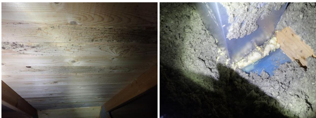
Kuvat 264 ja 265. Vesikatteen aluslaudoituksessa on monin paikoin mikrobikasvuston aiheuttamaa pilkkuuntumista. Yläpohjarakenteessa höyrynsulkuna on rakennusmuovi. Höyrynsulun läpivientejä on tiivistetty mm. polyuretaanivaahdolla.
