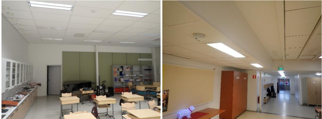
Kuvat 240 ja 241. Sisäkattopintoina ruokalaosan tiloissa on pääosin t-lista-alakattoja, joissa on akustiikkalevytyt. Paikoin on myös kiinteää maalattua kipsilevyä, joissa on reunoiltaan suljettuja akustiikkalevytyksiä.
