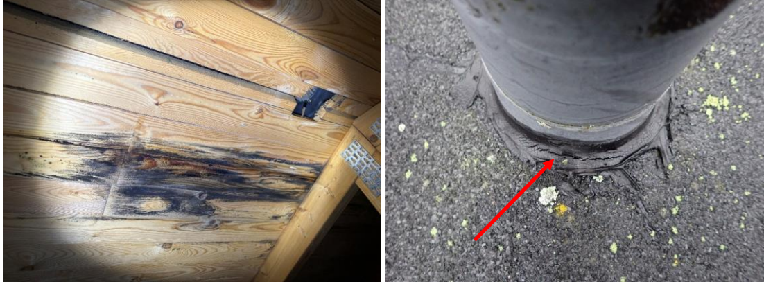
Kuvat 201 ja 202. Yksittäisen harjatuuletusventtiin läheisyydessä havaittiin märkä kohta aluslaudoituksessa. Tiivistysmassa tuuletusventtiin alaosassa on murtunut.
