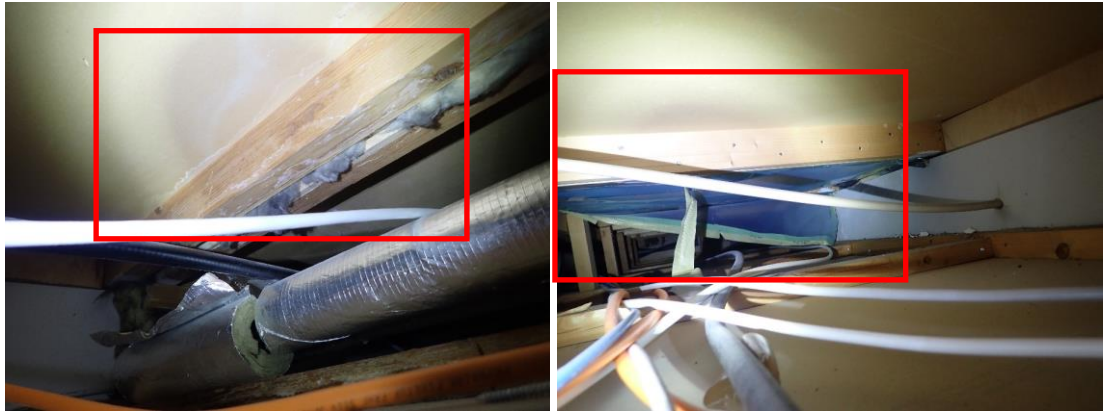
Kuvat 217 ja 218. (AK5). B- ja C-osan välisen yhdyskäytävän alakattotilassa on vanhoja kuivuneita vesivuotojälkiä, avoimia mineraalivillaisia putki- ja IV-kanavaeristeitä sekä epätiivis höyrynsulkumuovilla suljettu alue.
