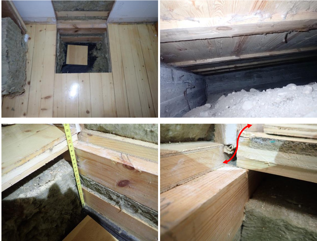
Kuvat 63, 64, 65 ja 66. Rakenneavaus R6 B-osan kuvaamataidonluokassa. Lankkulattiapinnan ja ulkoseinärakenteen rakenneliittymän ilmatiiveys on huono. Ryömintätilan korkeus vaihtelee suuresti.
