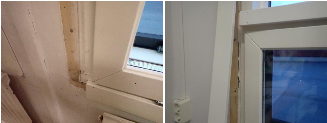
Kuvat 140 ja 141. B-rakennusosalla ikkuna - ulkoseinäliittymässä on elastinen saumamassa (R7 ikkuna, tila 9). Saumamassassa on rakoja. Merkkisavutarkasteluissa liittymässä havaittiin ilmavirtausta sisätiloihin päin. Myös A-rakennusosalla ikkuna - ulkoseinäliittymässä on elastinen saumamassa (R13 ikkuna, tila 5). Saumamassassa on rakoja. Merkkisavutarkasteluissa liittymässä havaittiin ilmavirtausta sisätiloihin päin.
