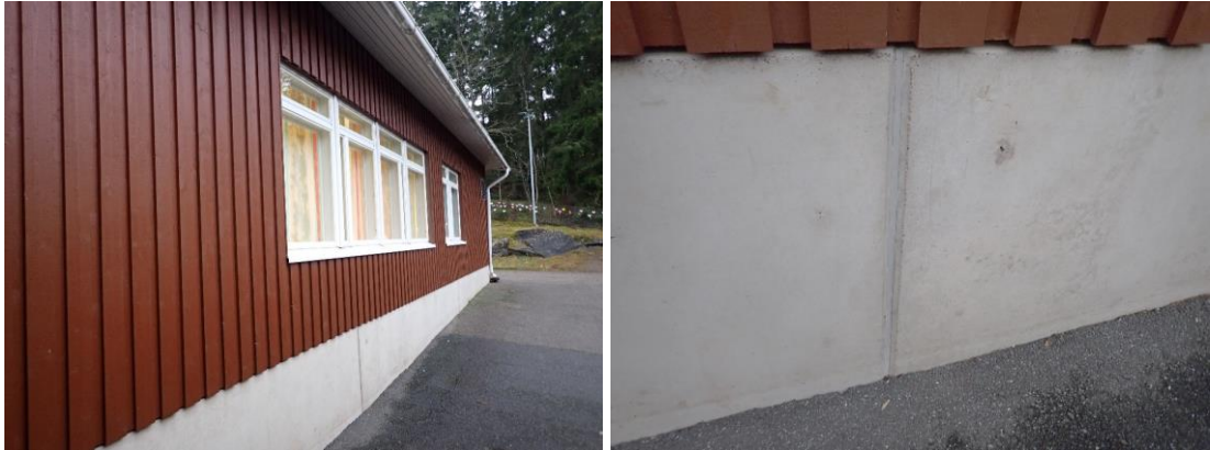
Kuvat 96 ja 97. C-osan julkisivuna on lomalaudoitus. Sokkelit ovat betonielementtirakenteisia. Elementtisaumat ovat hyväkuntoisia.
