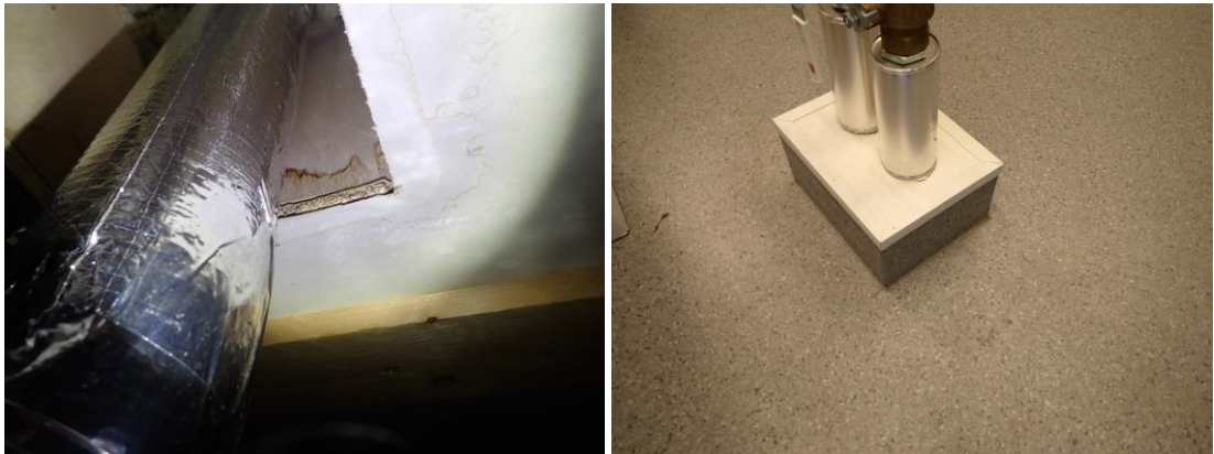
Kuvat 157 ja 158. IV-konehuoneen välipohjarakenteen putkiläpiviennistä tarkasteltuna välipohjarakenne vastaa suunnitelmia. Läpiviennin kohdalla havaittiin vanhoja kuivuneita kosteusjälkiä (AK18).
