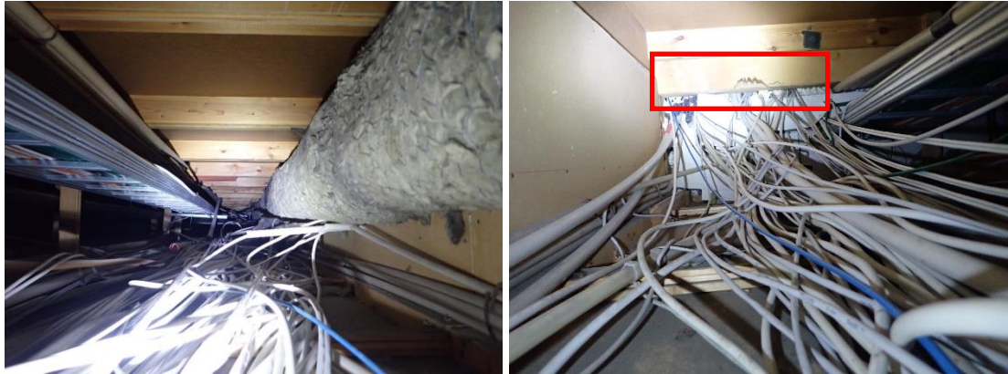
Kuvat 244 ja 245. (AK14) Ruokalaosan käytävän alakattotilassa on runsaasti pölyä ja avoimia mineraalivillaisia putki- ja IV-kanavaeristeitä. Alakattotilassa havaittiin vanhoja kuivuneita vuotojälkiä.
