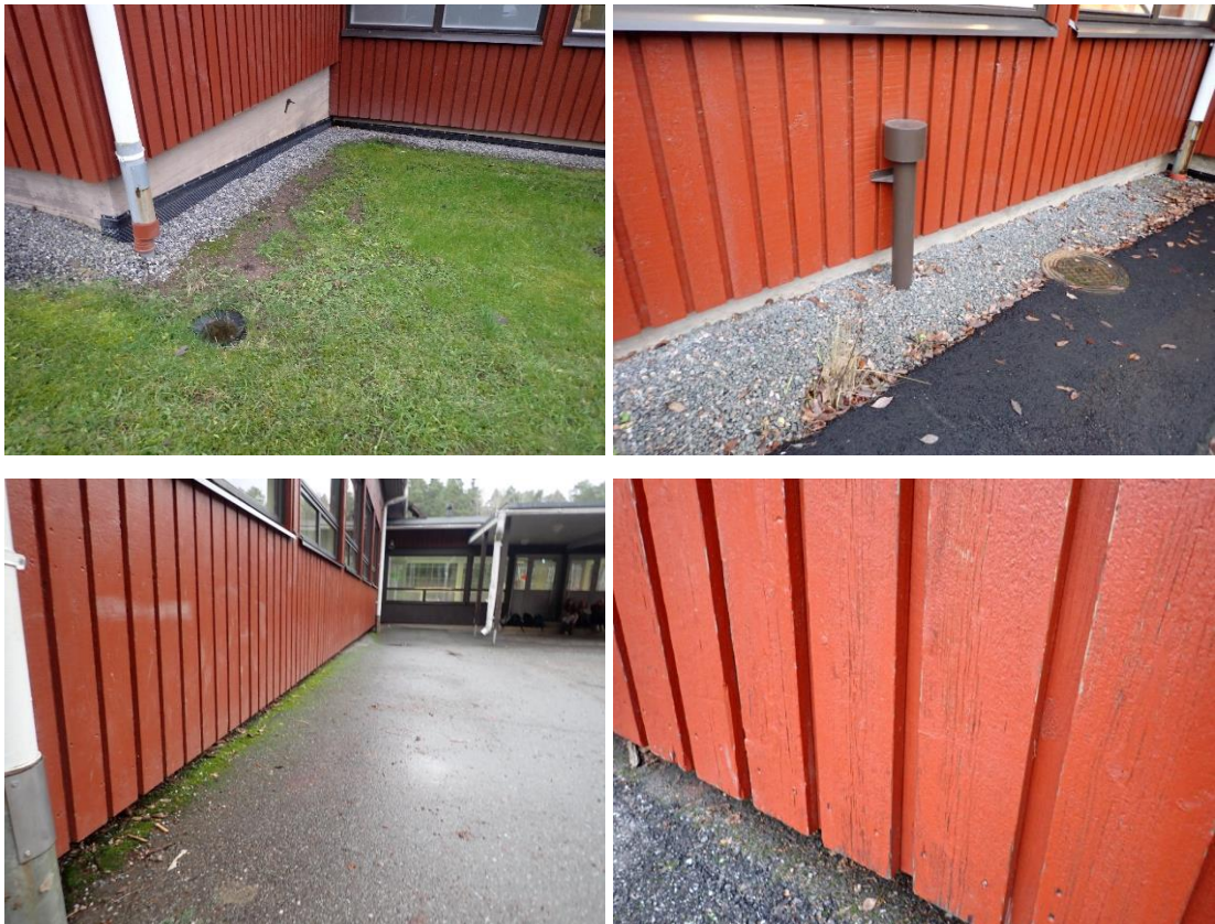
Kuvat 86, 87, 88 ja 89. Paikoin julkisivuverhous on lähellä maanpintaa (opettajienhuone, keittiö sekä A- ja B-osien itäpuolet). A-osan itäpuolella julkisivuverhoilun alaosassa on havaittavissa viitteitä kosteusrasituksesta.
