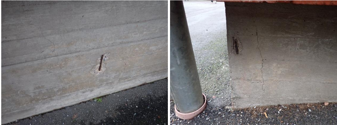
Kuvat 84 ja 85. Betonisokkeleissa havaittiin yksittäisiä hiushalkeamia ja raudoituksissa havaittiin paikallisia korroosiovaurioita.
