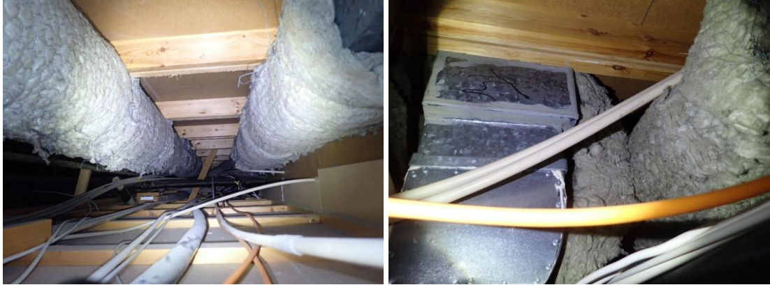
Kuvat 183 ja 184. (AK8). Käytävällä opettajienhuoneen edessä alakattotilassa on runsaasti pölyä ja avoimia mineraalivillaisia putki- ja IV-kanavaeristeitä.
