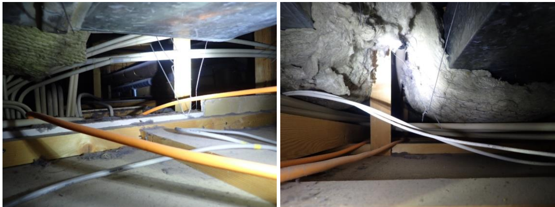
Kuvat 219 ja 220. (AK6) B-osan käytävällä alakattotilassa on runsaasti pölyä ja avoimia mineraalivillaisia putki- ja IV-kanavaeristeitä.
