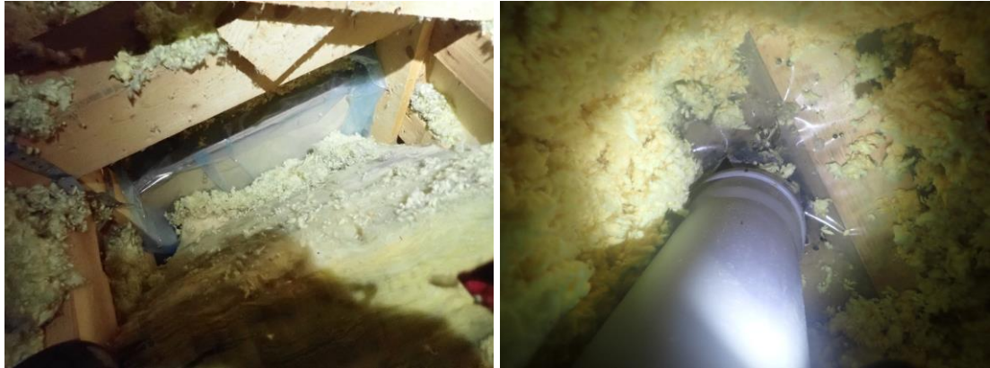
Kuvat 211 ja 212. Höyrynsulkumuovin limitykset, liitokset ja läpiviennit ovat epätyydyttäväitä.
