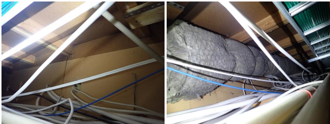
Kuvat 246 ja 247. (AK15) Ruokalaosan käytävän alakattotilassa on runsaasti pölyä ja avoimia mineraalivillaisia putki- ja IV-kanavaeristeitä.
