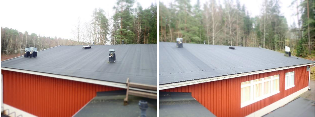
Kuvat 335 ja 336. Yleiskuvat C-osan huippuimureista. Huippuimurit ovat alkuperäisiä vuodelta 2000. Käyntiäänissä ei havaittu poikkeamia.
