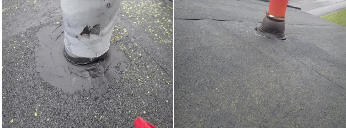
Kuvat 165 ja 166. Katteessa havaittiin yksittäisiä kupruja ja katteen pinnassa on vähäistä sammal- tai jäkäläkasvustoa. Vesikaton läpivientejä on havaintojen mukaan tiivistetty jälkikäteen.
