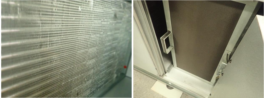
Kuvat 328 ja 329. Yleiskuvat lämmityspatterista ja äänenvaimennusosasta. Osat olivat hyväkuntoiset.
