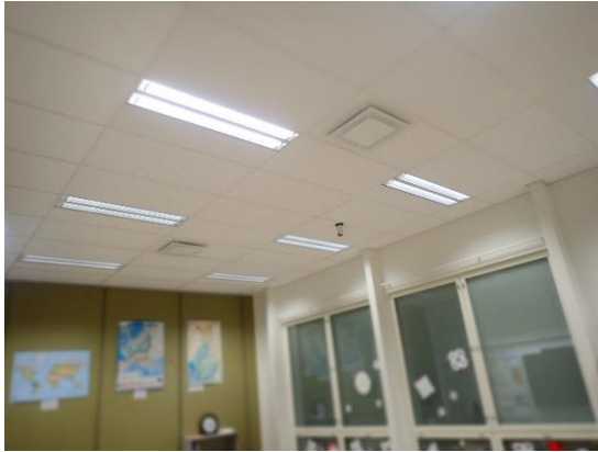
Kuva 361. Yleiskuva ruokalan rakennusosalla olevista luokkatilan tuloilmahajottajista. Ruokala-osan opetustilojen hajottajat olivat kattoasenteisia, niiden ilmajaon arvioidaan toimivan hyvin, mikäli tuloilman lämpötila on tilan sisäilman lämpötilaa alhaisempi.
