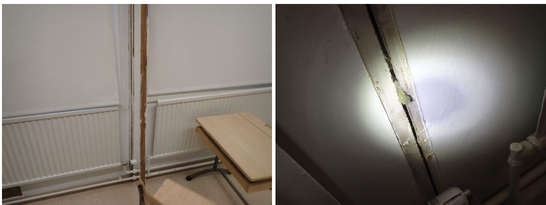
Kuvat 94 ja 95. Ulkoseinäelementtiliitos, B-osa luokkatila OT3. Liitoksessa on tiivisteenä vaahtomuovinauhaa, joka on hapertunutta. Merkkisavutarkasteluissa elementtiliitoksissa havaittiin ilmavuotoa sisätiloihin päin.
