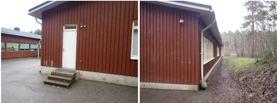
Kuvat 98 ja 99. Eteläpäädyssä julkisivu on hieman likaantunut ja kulunut. Seinään on mm. potkittu jalkapalloa.
