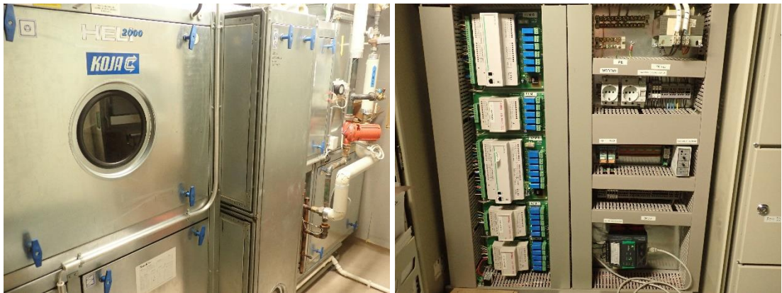
Kuvat 301 ja 302. Yleiskuvat ilmanvaihtokoneesta ja sitä ohjaavasta rakennusautomaation alakeskuksesta.
