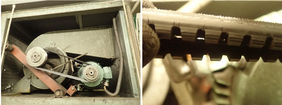
Kuvat 291 ja 292. Yleiskuvat tuloilmapuhaltimesta ja sen hihnoista. Puhallin on varustettu kahdella sähkömoottorilla (toinen on kuvassa näkyvän sähkömoottorin takana). Hihnaveto-osien havaittiin olevan kuluneet ja hihnojen alkaneen halkeilla.
