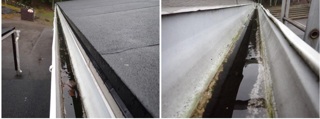
Kuvat 207 ja 208. Sadevesikouruissa B-osalla yleisesti kallistus- ja kiinnityspuutteita. Paikoin sadevesikourut ovat vääntyneet joko lumikuorman tai päälle astumisen takia. Vesi makaa sadevesikouruissa monin paikoin.
