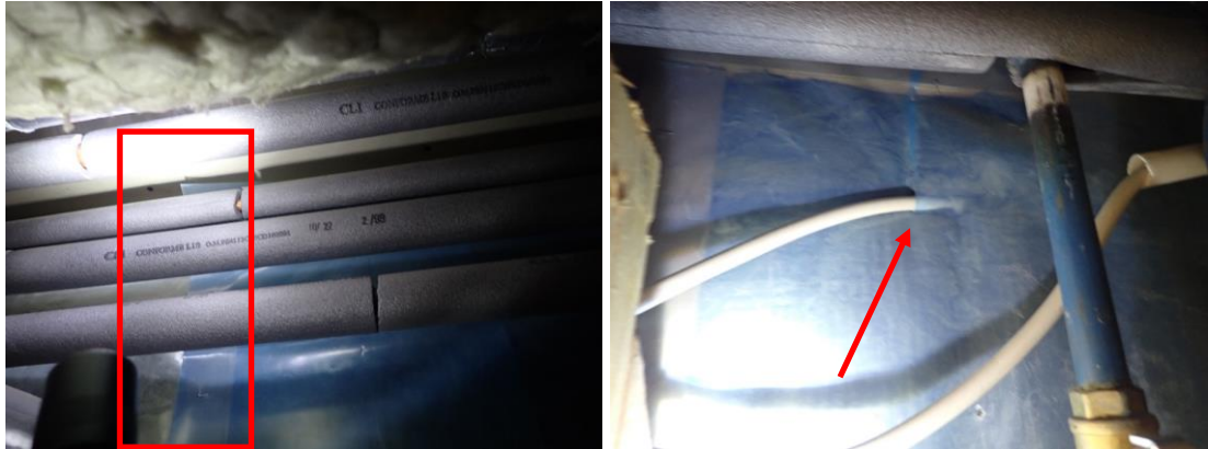
Kuvat 275 ja 276. Höyrynsulkumuovissa havaittiin ilmatiiveyspuutteita ja merkkisavutarkastelussa ja lämpökuvauksessa ilmavuotoa C-osan ja yhdyskäytävän liittymässä (AK4).
