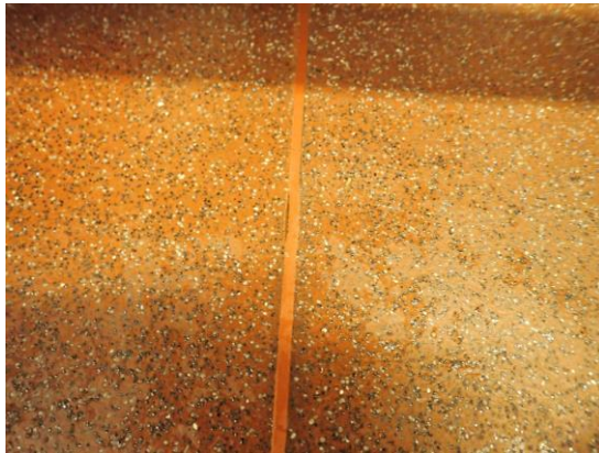
Kuva 35. Keittiön muovimaton saumoissa havaittiin paikallisia repeämiä.
