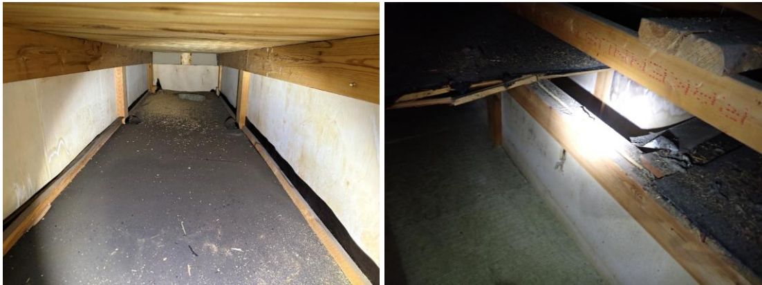
Kuvat 174 ja 175. Yläpohjarakenteissa on monin paikoin havaittavissa vanhoja vesivuotojälkiä ja mikrobikasvun aiheuttamaa pilkkuuntumista.
