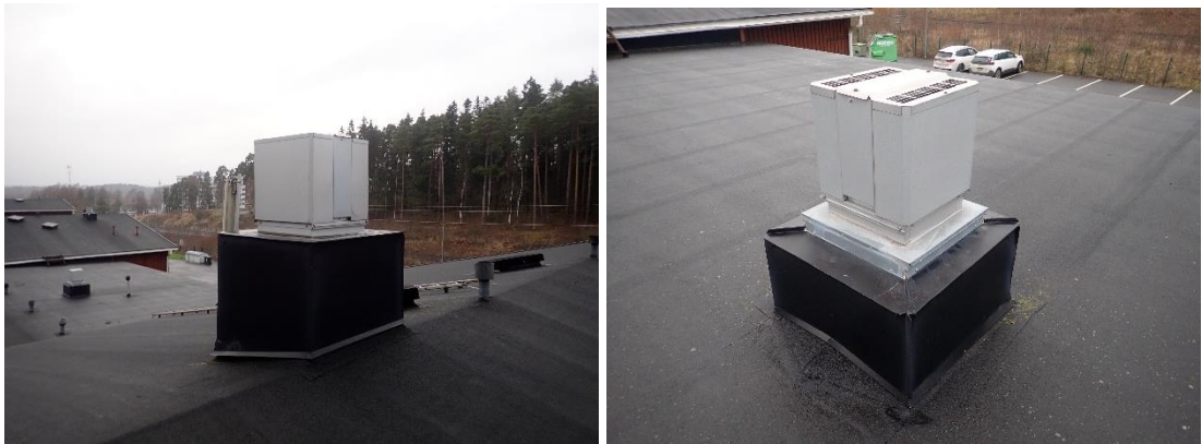
Kuvat 337 ja 338. Yleiskuvat B-osan huippuimureista. Imureissa ei havaittu positiotunnuksia ja ne olivat laitevalmistajan merkintöjen mukaan vuosilta 2014 ja 2017.
