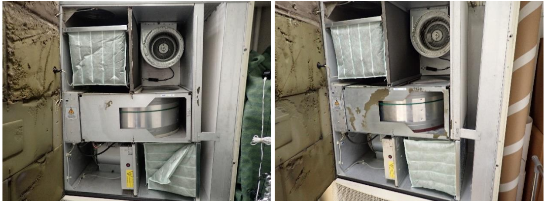
Kuvat 333 ja 334. Yleiskuvat paikallisista ilmanvaihtokoneista TK16 ja TK17. Koneet ovat sisäosiltaan silmämääräisesti hyväkuntoisia. Koneiden ilmamääräasetus oli käyttöpaneelin asetuksen perusteella n. \pm 290 l/s (tilojen alkuperäiset suunnittelu-arvot tulo- ja poistoilmavirtauksille ovat \pm 150 l/s).
