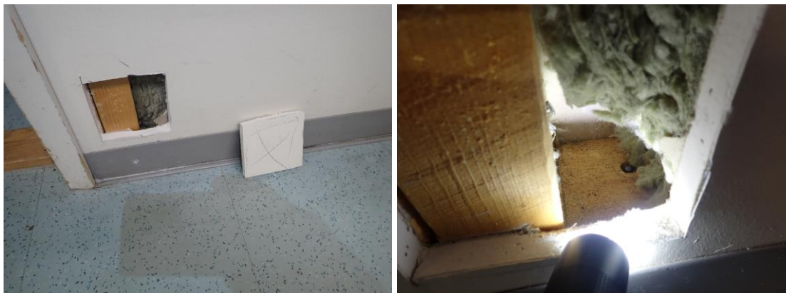
Kuvat 147 ja 148. Rakenneavaus R22. Avaus tehtiin C-osan luokkatilan 12 käytävän puoleisen väliseinän alaosaan. Rakenneavauksesta otettiin näyte N2 (mineraalivilla) mikrobialyysiin. Näytteessä ei esiintynyt mikrobikasvustoa.
