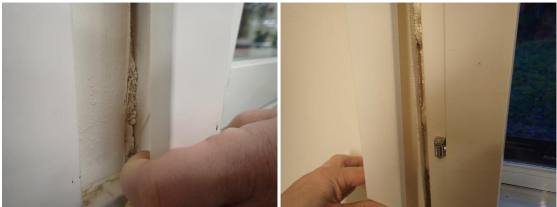
Kuvat 142 ja 143. C-rakennusosan ikkuna - ulkoseinäliittymässä on polyuretaanivaahdotus. (R3 ikkuna, tila 19), (R2 ikkuna, tila 22). Merkkisavutarkasteluissa liittymässä havaittiin heikkoa ilmavirtausta ulospäin.
