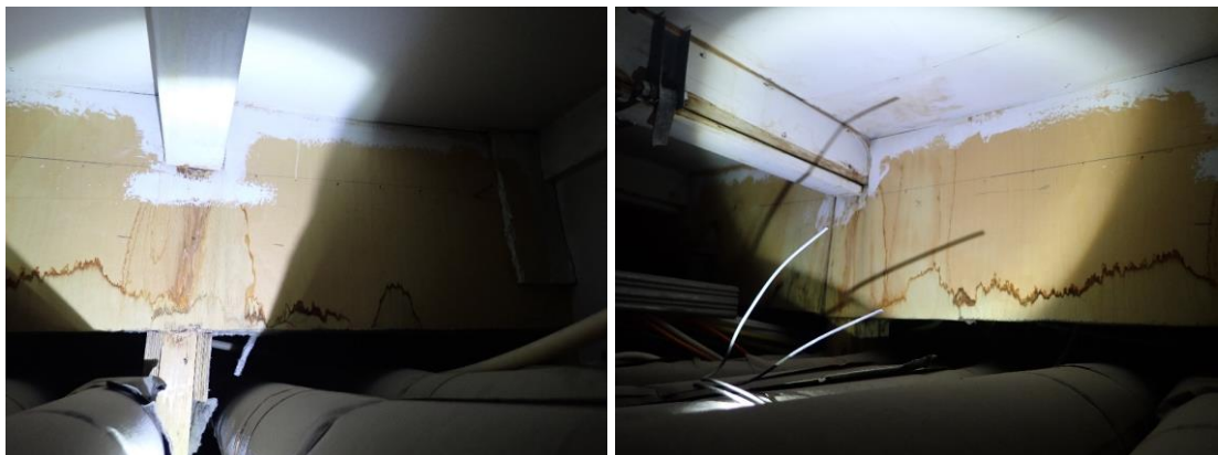
Kuvat 248 ja 249. (AK16) Ruokalaosan käytävän alakattotilassa on runsaasti pölyä ja avoimia mineraalivillaisia putki- ja IV-kanavaeristeitä. Alakattotilassa havaittiin vanhoja kuivuneita vuotojälkiä.
