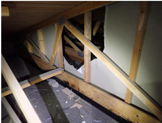
Kuva 233. Yläpohjatilassa oleva palokatkoseinä on rikottu.
