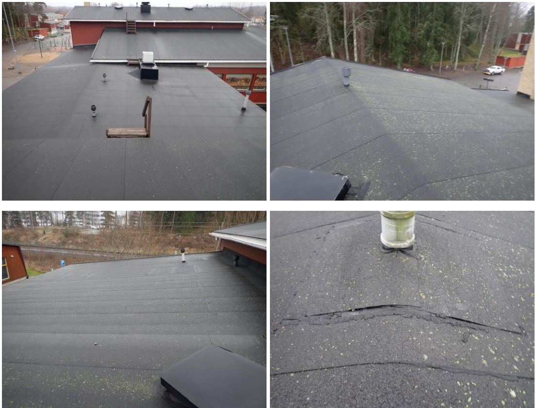
Kuvat 223, 224, 225 ja 226. Yleiskuvia ruokalaosan vesikatolta. Kate on yleisesti hyväkuntoinen. Vesikatteen pinnassa on vähäistä sammal- tai jäkäläkasvustoa. Vesikaton läpivientejä on havaintojen mukaan tiivistetty jälkikäteen.
