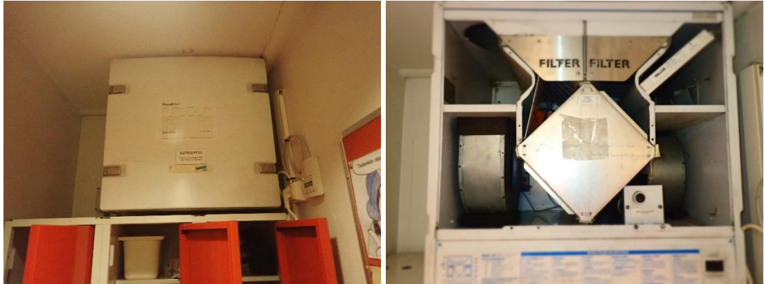
Kuvat 318 ja 319. Yleiskuvat ilmanvaihtokoneesta ulkopuolelta ja aukaistuna. Kone oli sisäosiltaan siistikuntoinen.
