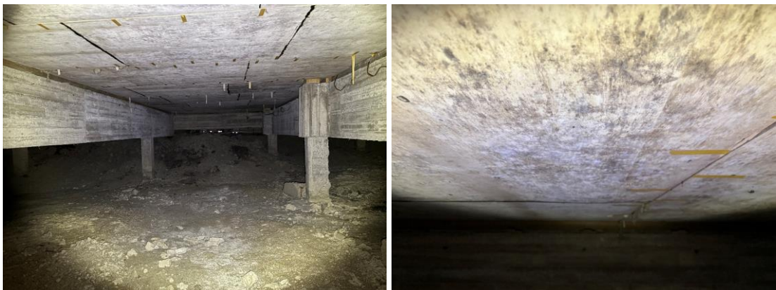
Kuvat 40 ja 41. Vanhan juhlasalin alapohjarakenteen alapinnan vaneri on paikoin pilkkuuntunut mikrobikasvustosta.
