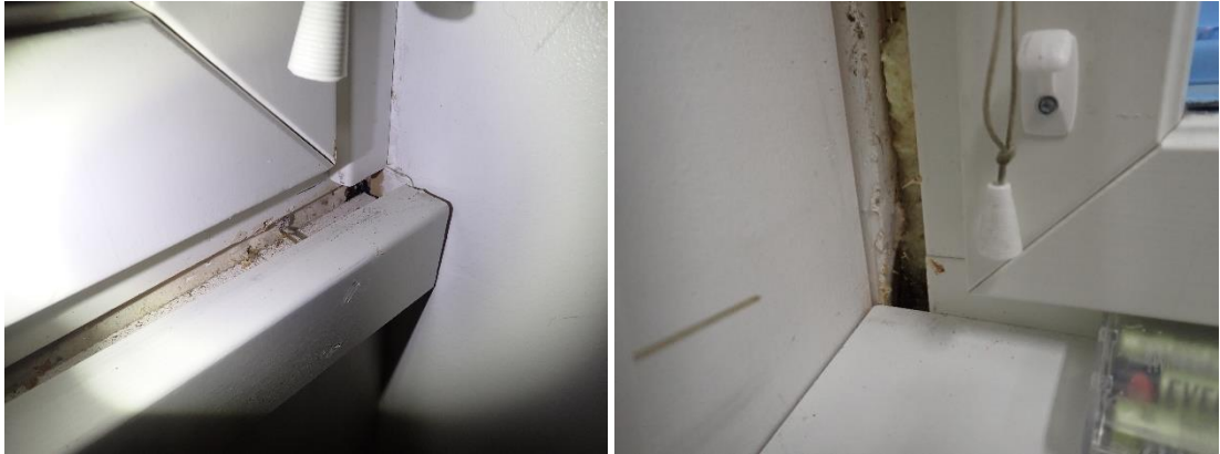
Kuvat 138 ja 139. Ikkuna - ulkoseinäliittymässä on polyuretaanivaahdotus (R20 ikkuna, ruokalaosa, tila 20). Merkkisavutarkasteluissa liittymässä havaittiin heikkoa ilmavirtausta sisätiloihin päin.
