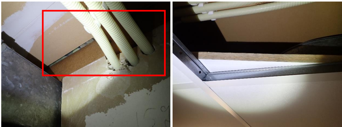
Kuvat 187 ja 188. (AK10) Opettajienhuoneen miesten wc-tilan alakaton yläpuolella havaittiin merkittävää ilmavuotoa yläpohjatilasta sisätiloihin päin merkisavutarkastelussa ja lämpökuvauksessa (AK10).
