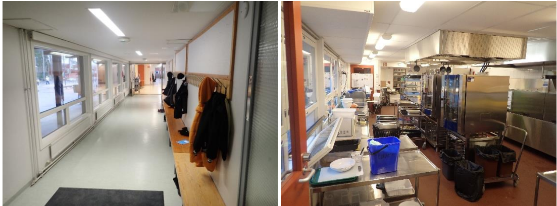
Kuvat 242 ja 243. Käytävätiloissa on t-lista-alakattoja akustiikkalevytyksin tai sisäkattot ovat maalattua kipsilevyä. Wc- ja keittiötiloissa t-lista-alakattoissa on märkätilelevyt.
