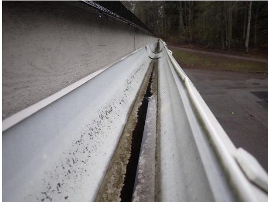
Kuva 169. Paikoin sadevesikourut ovat vääntyneet ja vesi makaa sadevesikouruissa monin paikoin.
