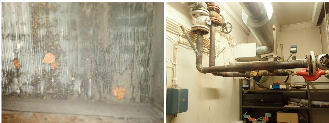
Kuvat 289 ja 290. Yleiskuvat lämmityspatterista ja sen putkikytkennästä. Lämmityspatterin havaittiin olevan merkittävän likainen. Lämmityspatterin lämmityspiirin putkiston komponentit ovat pääosin alkuperäiset 70-luvulta.
