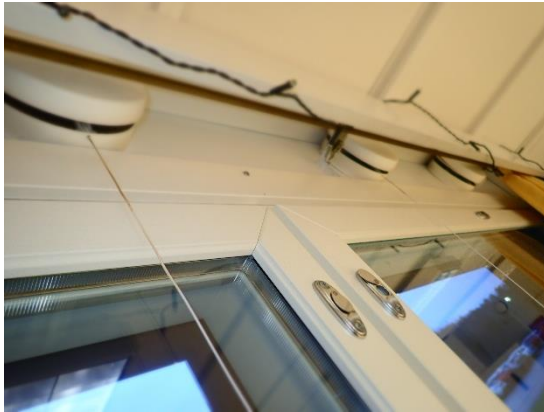
Kuva 362. B-osalla sijaitsevassa opettajainhuoneessa havaittiin ulkoseinään asennettuja korvausilma-venttiileitä. Lähtöaineistoista ei käynyt ilmi olivatko venttiilit alkuperäisiä vai jälkikäteen asennettuja.
