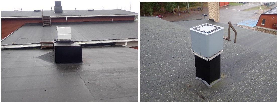
Kuvat 341 ja 342. Yleiskuvat keittiötä palvelevasta huippuimurista (vasen) ja ruokalan wc-tiloja palvelevasta huippuimurista (oikea). Ruokalan huippuimurissa havaittiin tavanomaisesta poikkeava käyntiäänäni. Huippuimurit ovat 2010-luvulta.
