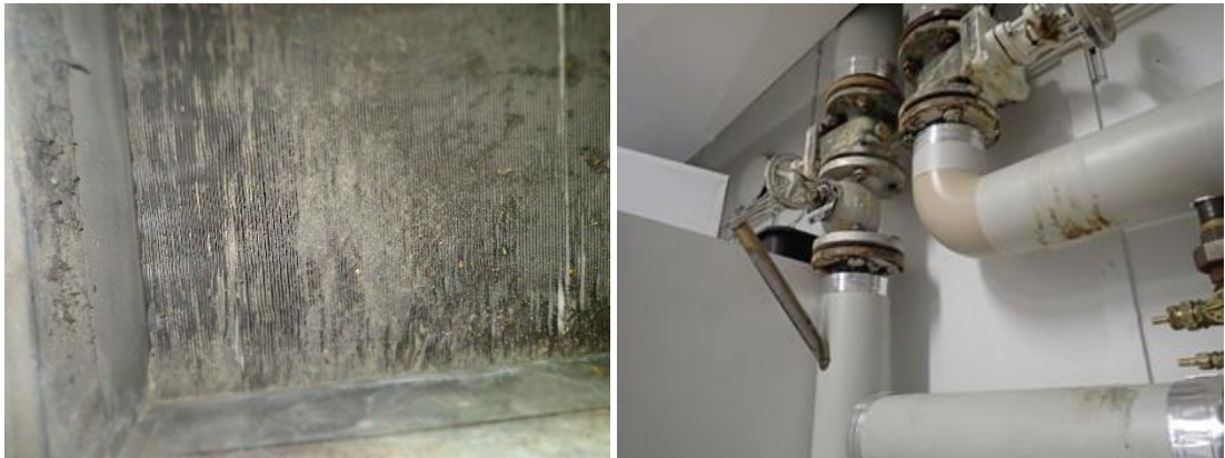
Kuvat 297 ja 298. Yleiskuvat lämmityspatterista ja sen putkikytkennästä. Lämmityspatterin havaittiin olevan merkittävän likainen. Lämmityspatterin lämmityspiirin putkiston komponentit ovat pääosin alkuperäiset 70-luvulta.
