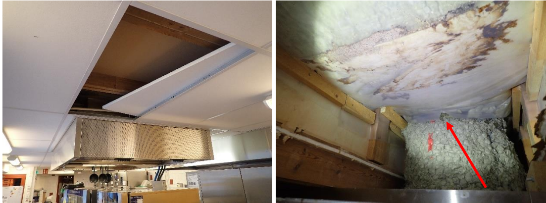
Kuvat 250 ja 251. (AK19) Keittiötiloissa alakaton yläpuolella havaittiin vaurioalue höyrynsulkumuovin yläpuolella. Keittiötilassa yläpohjan höyrynsulkumuovin ilmatiiveys on rakenneliittymien ja läpivientien osalta erittäin huono.
