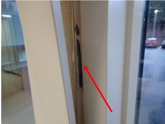
Kuva 144. B- ja C-rakennusosien välisen yhdyskäytävän ikkuna - ulkoseinäliittymässä on elastinen saumamassa (R4 ikkuna, yhdyskäytävä). Saumamassassa on isoja rakoja. Merkkisavutarkasteluissa liittymässä havaittiin heikkoa ilmavirtausta sisätiloihin päin.
