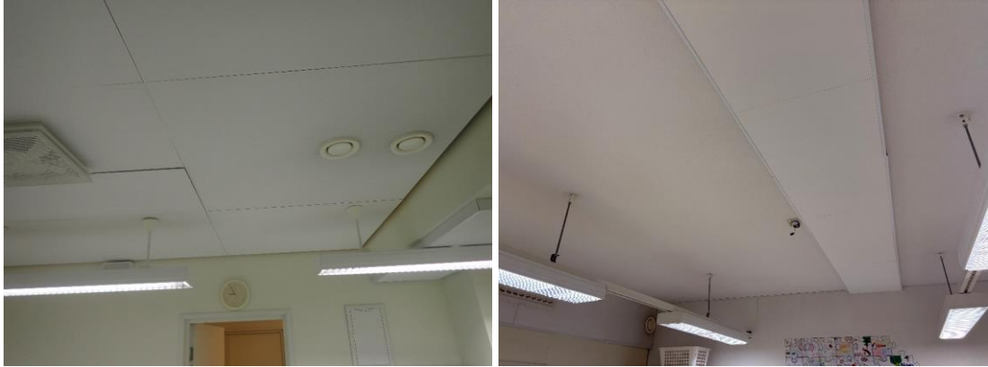
Kuvat 266 ja 267. Sisäkattopintoina C-osan tiloissa on maalattu kipsilevy. Kipsilevyypinnalla on mineraalivillaisia akustiikkalevyjä, joissa osin on avonaiset reunat ja osin reunat on suljettu listoituksin.
