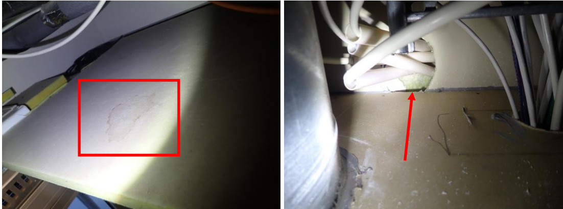
Kuvat 269 ja 270. (AK1). Tuulikaapissa alakattolevyssä on kuivunut vesivuotojälki. Jäljet ovat aiheuttaneet ilmalämmittimen vähäisestä vuodosta. Akustiikkalevyt ovat reunoiltaan avoimia mineraalivillalevyjä. Väliseinä ja yläpohjaläpiviennissä on avoimia mineraalivillapintoja. Alakattotilassa ei ole pölyä.
