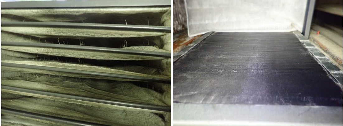
Kuvat 295 ja 296. Yleiskuvat tuloilmasuodattimesta ja suodatinosasta. Suodatin on hieman pölyinen ja suodatin osan sisäpinnoilla on kangaspinoitetut äänenvaimennuslevyt. Kammion peltiosissa havaittiin paikoin pintakorroosiota.
