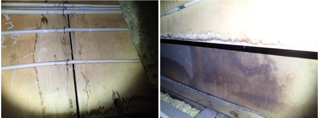
Kuvat 195 ja 196. A-osan kotelorakenteen tarkastus hallin sisäänkäynnin yläpuolelta (R24 kotelo). Kotelon sisällä on paljon vanhoja kattovuodon tai kondenssin aiheuttamia kosteusjälkiä.
