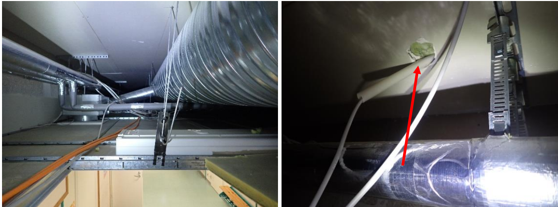
Kuvat 271 ja 272. (AK2) C-osalla alakattotilat ovat yleisesti puhtaita. Väliseinä ja yläpohjaläpiviennissä on avoimia mineraalivillapintoja.
