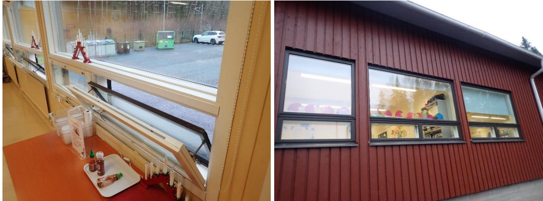
Kuvat 128 ja 129. Ruokalan puurakenteisten ikkunoiden sekä A- ja B osien luokkahuoneiden ikkunoiden yläosissa on kiinteät eristyslaselementit ja alaosissa sisään aukeavat puu-alumiini-ikkunat, joiden sisemmässä puitteessa on kaksilasinen umpiolasielementti.
