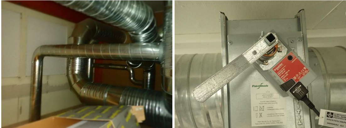
Kuvat 365 ja 366. Yleiskuvat ruokalan rakennusosan ilmastovaihtokanavistosta. IV-konehuoneen sisäisissä kanavissa on vyöhyke-/tehostuspeltejä.
