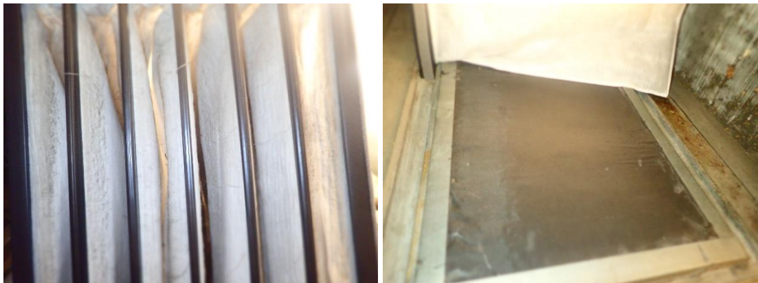
Kuvat 287 ja 288. Yleiskuvat tuloilmasuodattimesta ja suodatinosasta. Suodatin on lähes puhdas ja suodatinosan sisäpinoilla on kangaspinnoitetut äänenvaimennuslevyt. Kammion peltiosissa havaittiin paikoin pintakorrosiota.
