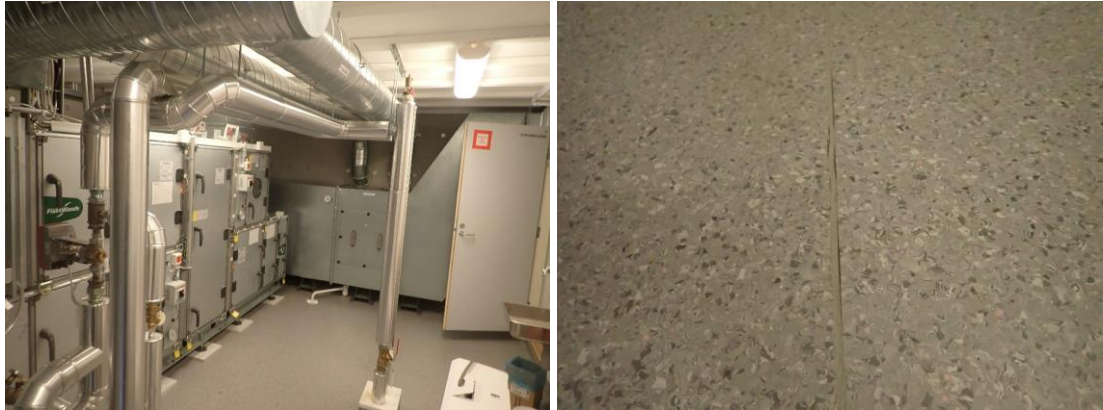
Kuvat 151 ja 152. Ilmanvaihtokonehuoneen lattiapäällysteenä on muovimatto. Muovimaton saumoissa havaittiin paikallisia repeämiä.
