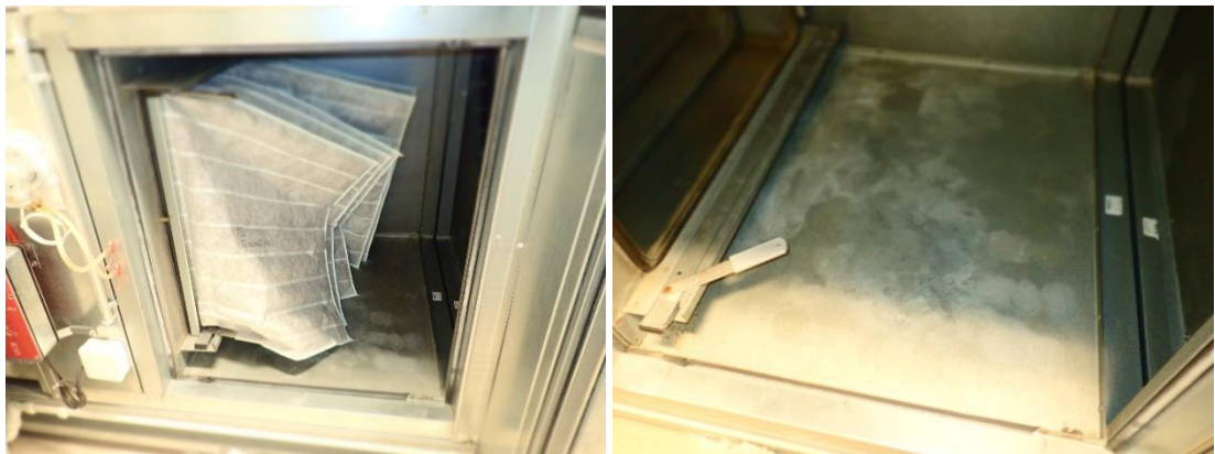
Kuvat 303 ja 304. Yleiskuvat tuloilmasuodattimesta ja suodatinosan pohjalta. Suodatinosan pohjalla oli vanhoja kosteusjälkiä.
