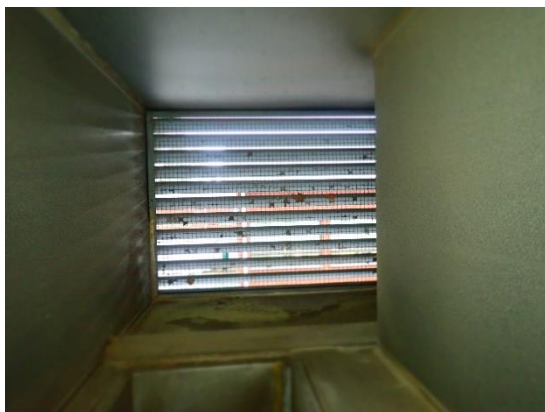
Kuva 309. Yleiskuva ulkoilmakammioista. Ulkoilmasäleikön suojaverkossa havaittiin hiukan lehtiä ja ulkoilmakammion pohjalla vanhoja kosteusjälkiä.
