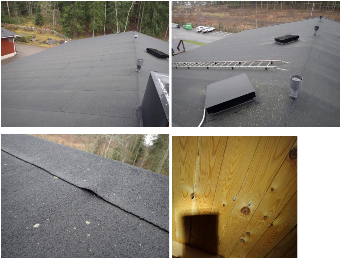
Kuvat 197, 198, 199 ja 200. Yleiskuva vesikatolta. Bitumikermikate on asennettu vuoden 2004 vesikaton muutostöiden aikana. Katteessa on havaittavissa yksittäisiä epätiiviyyskohtia saumoissa. Lapetikoiden kiinnityskohdissa ei havaittu vesivuotoja.
