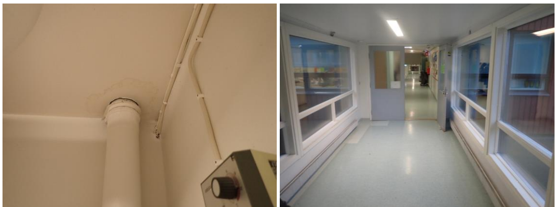
Kuvat 215 ja 216. Kuvaamataidonluokan varastotilan sisäkatoissa havaittiin vanha vesivuotojälki viemärin tuuletusputken ympärillä. B- ja C-osan välisellä yhdyskäytävällä sisäkatto on kiinteä maalattu kipsilevykatto.
