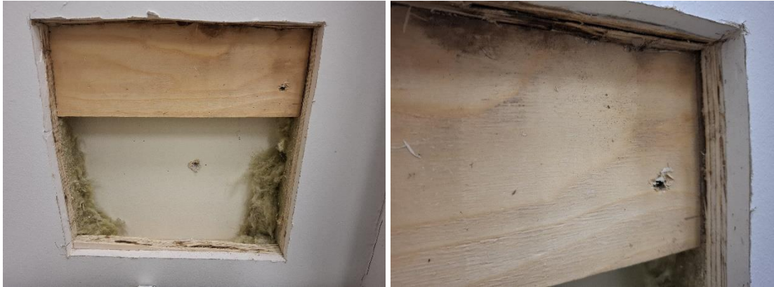
Kuvat 117 ja 118. Rakenneavaus R18 ruokalaosan tilassa 18 (musiikkiluokka). Runkopuussa ja mineraalivillassa havaittiin hieman tummumaa.
