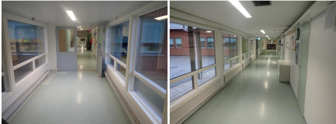
Kuvat 130 ja 131. B- ja C-osan välisellä yhdyskäytävällä, käytävällä opettajainhuoneen edustalla sekä keittiön viereisellä käytävällä puurakenteisissa ikkunoissa on eristyslaselementit.
