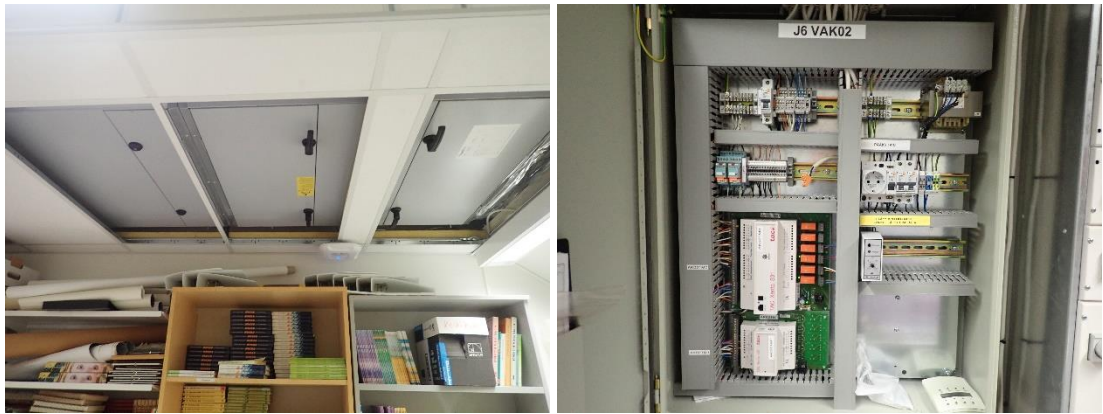
Kuvat 310 ja 311. Yleiskuva tuloilmakoneesta TK02 ja sitä ohjaavasta rakennusautomaation alakeskuksesta.
