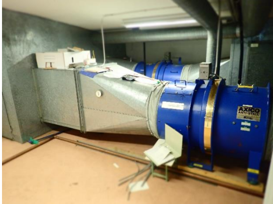
Kuva 121. Yleiskuva ilmanvaihtokoneesta TK01.
