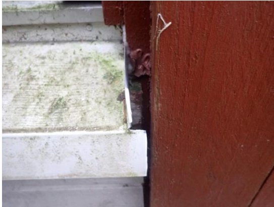
Kuva 88. Ikkunoiden vesipellityksissä havaittiin yksittäisiä paikallisia vesitiiviyspuutteita.
