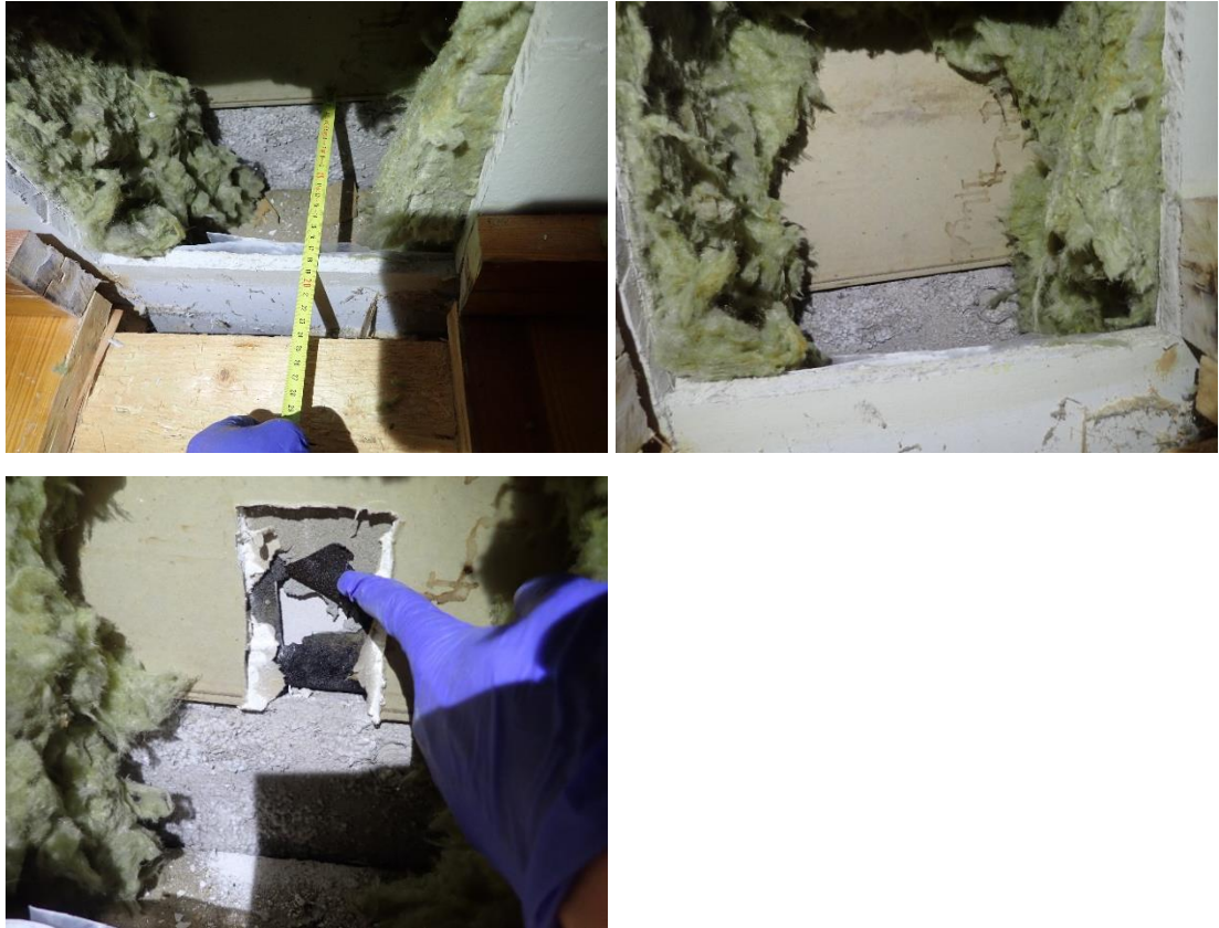
Kuvat 65, 66 ja 67. Rakenneavaus R2 tehtiin liikuntasalin länsipäädyn varastotilan ulkoseinärakenteeseen. Avauksesta otettiin näyte N5 (mineraalivilla) mikrobianalyysiin. Näytteessä havaittiin mikrobikasvustoa.
