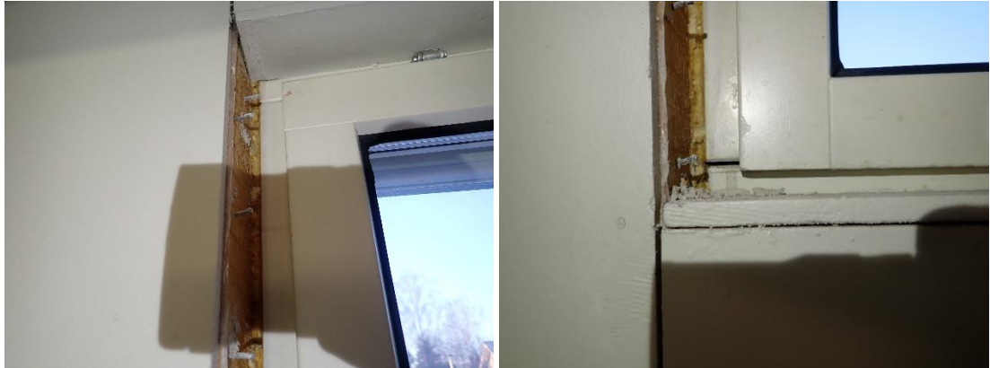
Kuvat 59 ja 60. Ikkuna-ulkoseinäliittymän avaus (R1) wc-tilassa 120. Höyrynsulkumuovin reuna näkyy Ilves-levyn takana. Ikkuna-ulkoseinäliittymässä on polyuretaanivaahdotus. Merkkisavutarkasteluissa ikkuna - ulkoseinäliittymässä todettiin vähäistä ilmavuotoa.
