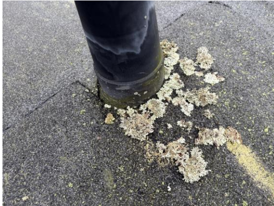
Kuva 112. Vesikatteen läpiviennit ovat paikoin huonokuntoisia.
