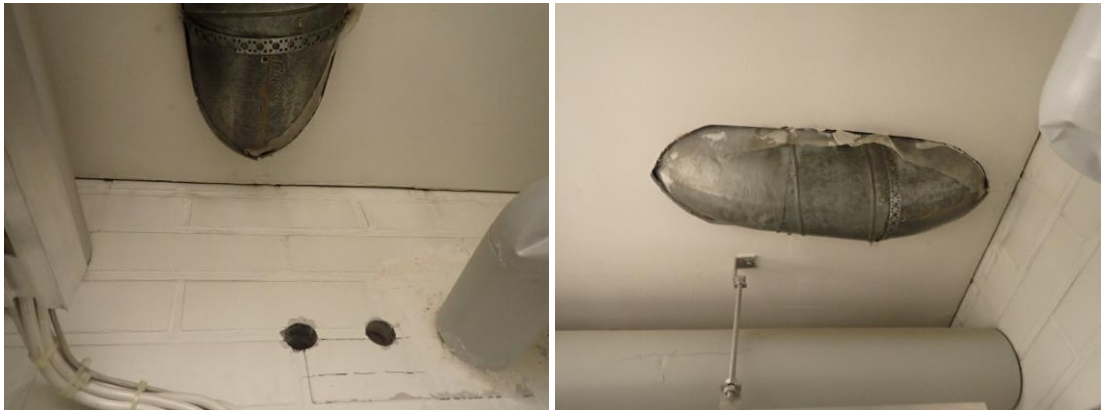
Kuvat 119 ja 120. Ulkoseinä - yläpohjaliittymissä ja yläpohjarakenteen läpivienneissä havaittiin silmä määräisesti ilmatiiveyspuutteita ja merkisavutarkastelussa ilmavuotoa.
