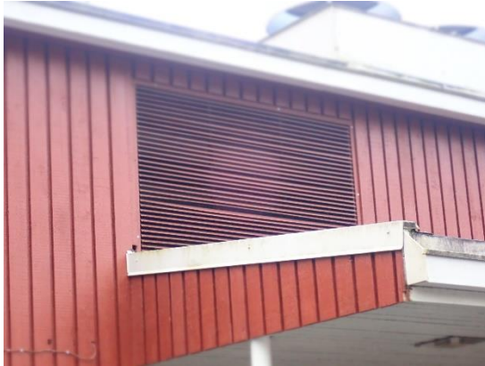
Kuva 140. Yleiskuvat ilmanvaihtokoneen ulkoilmanotosta.
