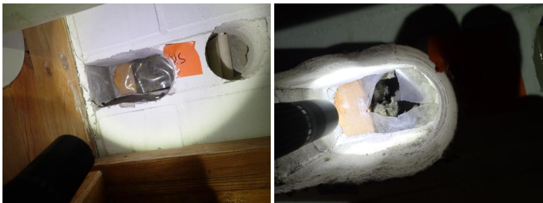
Kuvat 68 ja 69. Rakenneavaus R4 tehtiin liikuntasalin pohjoispuolen sisäpuolelta tiiliverhoiltuun ulkoseinärakenteeseen. Avauksesta otettiin näyte N6 (mineraalivilla) mikrobianalyysiin. Näytteessä ei havaittu mikrobikasvustoa. Avauksen yhteydessä havaittiin mikrobivaurioon viittaavaa hajua.
