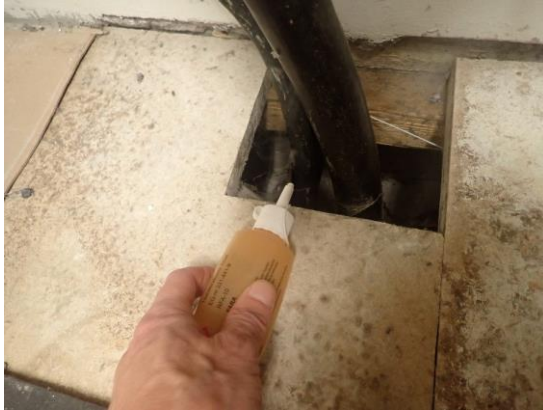
Kuva 26. Alapohjarakenteen läpiviennissä havaittiin merkkisavutarkasteluissa ilmatiiveyspuutteita.
