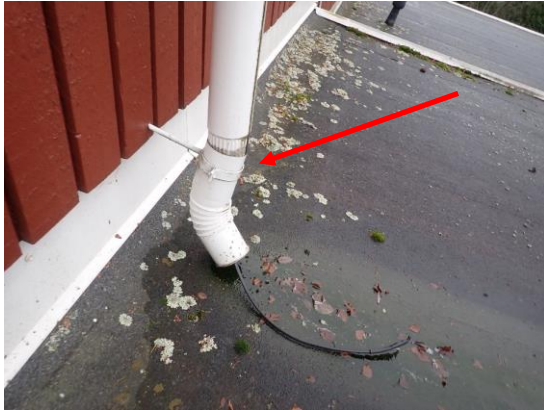
Kuva 107. Yksittäinen syöksytorven liitos on irronnut vesikatolla.
