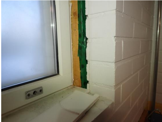
Kuva 64. Ikkuna-ulkoseinäliittymän avaus (R12) pukuhuoneillassa 120. Höyrinsulkumuovin reunassa on höyrinsulkuteippaus vasten puurunkoa. Ikkuna-ulkoseinäliittymässä on polyuretaanivaahdotus. Merkkisavutarkasteluissa ikkuna - ulkoseinäliittymässä ja höyrinsulun teippauksessa todettiin vähäistä ilmavuotoa. Teippaus ei ole tiiviisti kiinni puurungossa.
