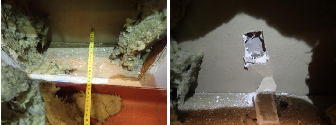
Kuvat 74 ja 75. Rakenneavaus R9 tehtiin kuntosalin pohjoisen puoleiselle ulkoseinälle. Avauksesta otettiin näytteet N1 (mineraalivilla) ja N2 (tuulensuojakipsilevyn ulkopinnan kartonki) mikrobianalyyysiin. Molemmissa Näytteissä havaittiin mikrobikasvustoa.
