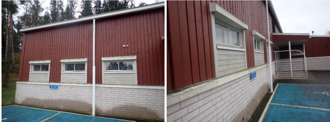
Kuvat 48 ja 49. Tiilijulkisivu kastuu julkisivun vesipellin päältä valuvasta vedestä kuntosalin kohdalla.
