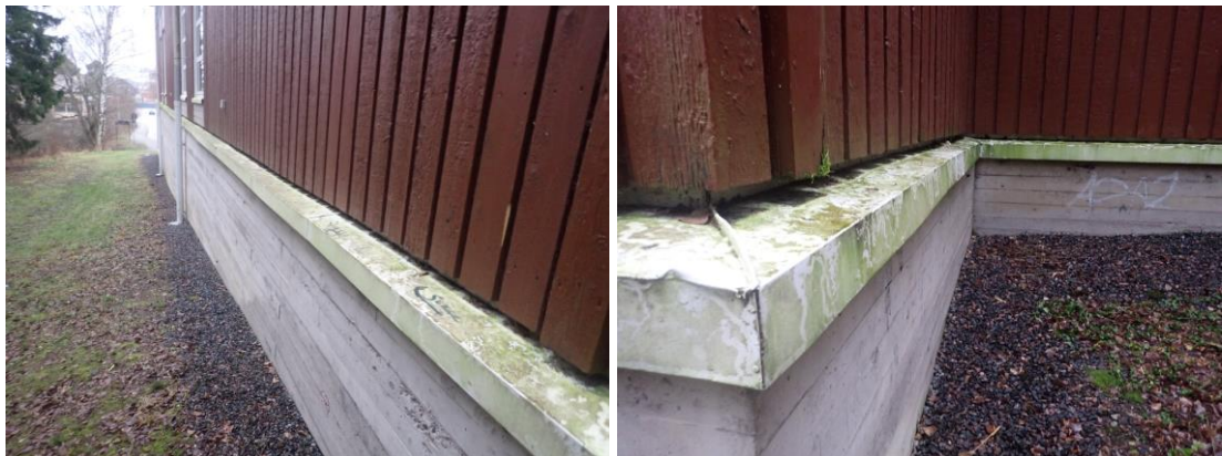
Kuvat 44 ja 45. Julkisivupellitykset likaantuvat erityisesti etelänpuoleisella julkisivulla metsikön läheisyydessä.
