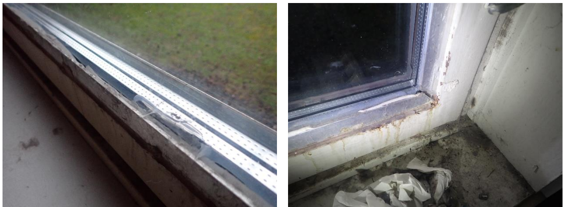
Kuvat 86 ja 87. Paikoin liikuntasalin ikkunoissa silikonitiivistykset ovat irronneet ja ikkunakarmeissa on ruostevaurioita.
