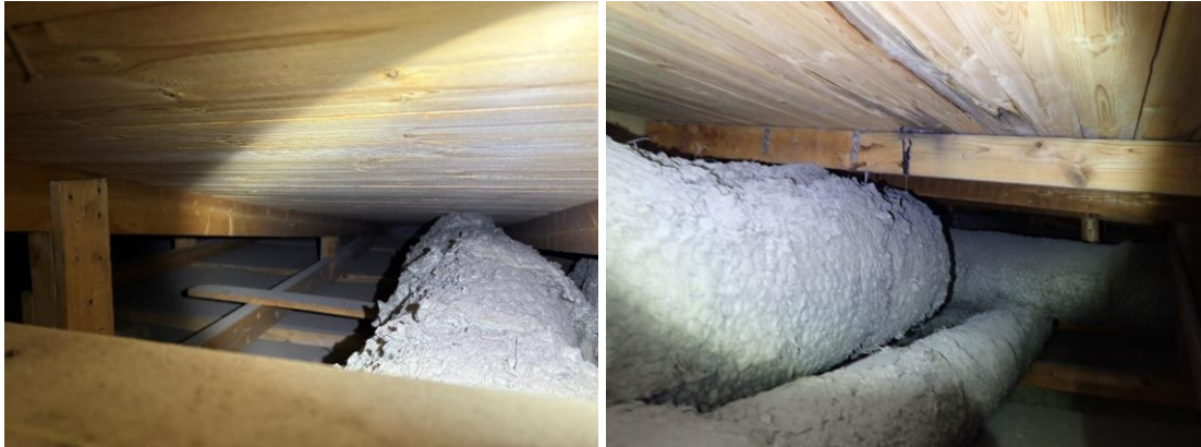
Kuvat 117 ja 118. Vesikaton aluslaudoituksessa havaittiin yksi paikallinen vanha jo kuivunut vesivuotoalue.
