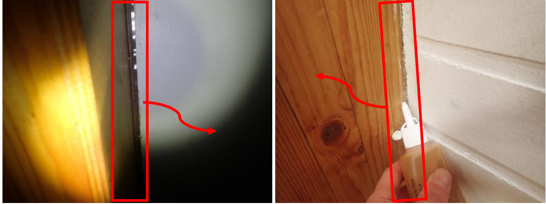
Kuvat 53 ja 54. Höyrynsulkumuovin liitos kantavaan liimapuupilariin on silmämääräisesti havainnointuna epätiivis. Puhtaaksi muuratun tiiliseinän liitoksessa kantavaan liimapuupilariin havaittiin merkkisavutarkastelussa vähäistä ilmavuotoa sisätiloihin päin.
