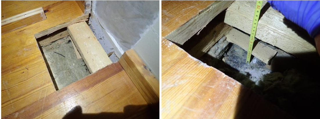
Kuvat 31 ja 32. Rakenneavaus R3. Puukorokelattian korkeus on noin 200 mm. Rakenteessa on betonilaatan yläpinnassa bitumisively ja mineraalivillaeristys 50 mm. Rakenneavauksesta otettiin materiaalinäyte N4 (mineraalivilla) mikrobianalyysiin. Näytteessä havaittiin mikrobikasvustoa.
