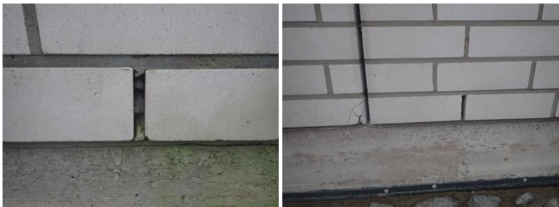
Kuvat 46 ja 47. Tiilimuurauksen alimmassa tiilirivissä on avoimia pystysaumoja, mutta havaintojen perusteella tuuletusraot ovat paikoin täynnä laastipurseita. Lisäksi tiilijulkisivussa on avoimia saumaamattomia liikuntasauvoja.
