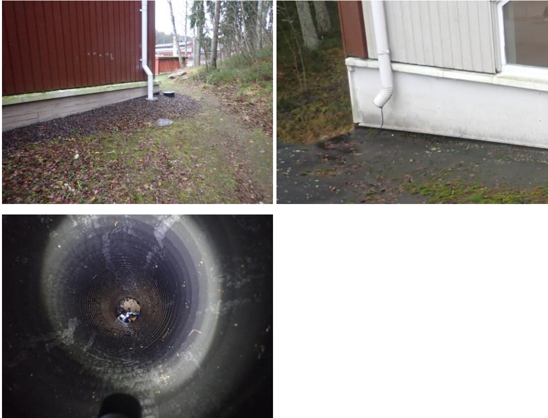
Kuvat 11, 12 ja 13. Kattovedet johdetaan syöksytorvista sadevesijärjestelmään. Syöksytorvissa on saattolämmityskaapelit. Piha-alueilla on sadevesi- ja salaojakaivoja. Salaojakaivojen pistokoeluontiossa tarkastelussa salaojajärjestelmässä havaittiin puhdistustarvetta.
