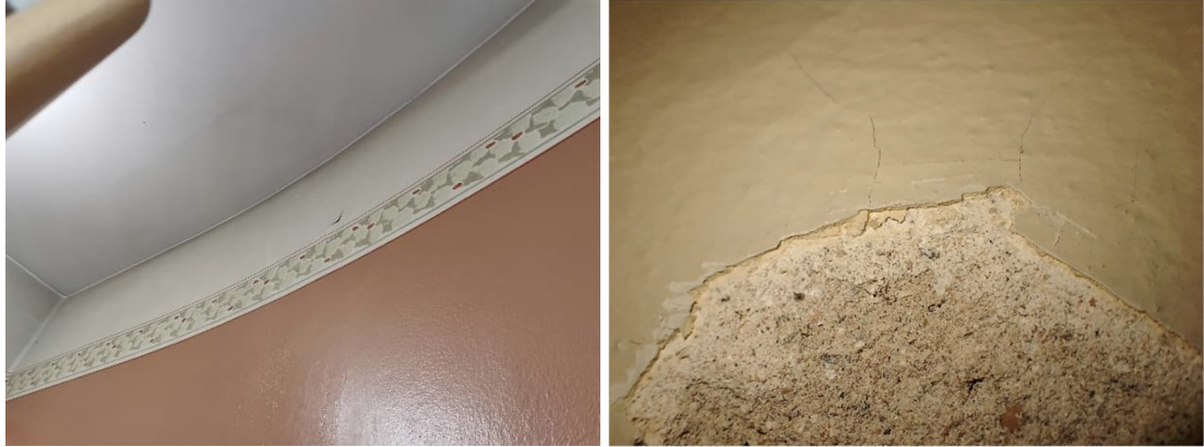
Kuvat 101 ja 102. Kirjaston 315 ulkoseinän yläreunan lohkeilevaa tasoitetta. Materiaalinäytteenoton yhteydessä uusimman pinnan alla havaittiin mahdollista kellastumaa tai eriväristä tasoitetta.
