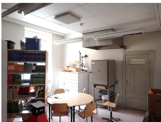
Kuva 366. Tilassa 321 havaittiin käytöstä poistettu keramiikkauunin huuva.
