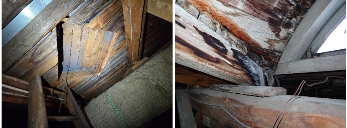
Kuvat 253 ja 254. Vanhoja kattovuotojälkiä ullakolla 503 ja 501.
