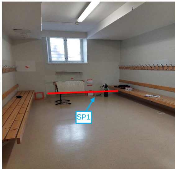
Kuva 49. Pukuhuoneen 040 alapohjan merkkiainekokeessa MA2 havaittiin ilmapuotoa muovimaton ylösnoston päältä vain muovimattoja raottamalla (punainen viiva). Kaasun syöttöpiste (SP) on merkitty sinisellä nuolella.
