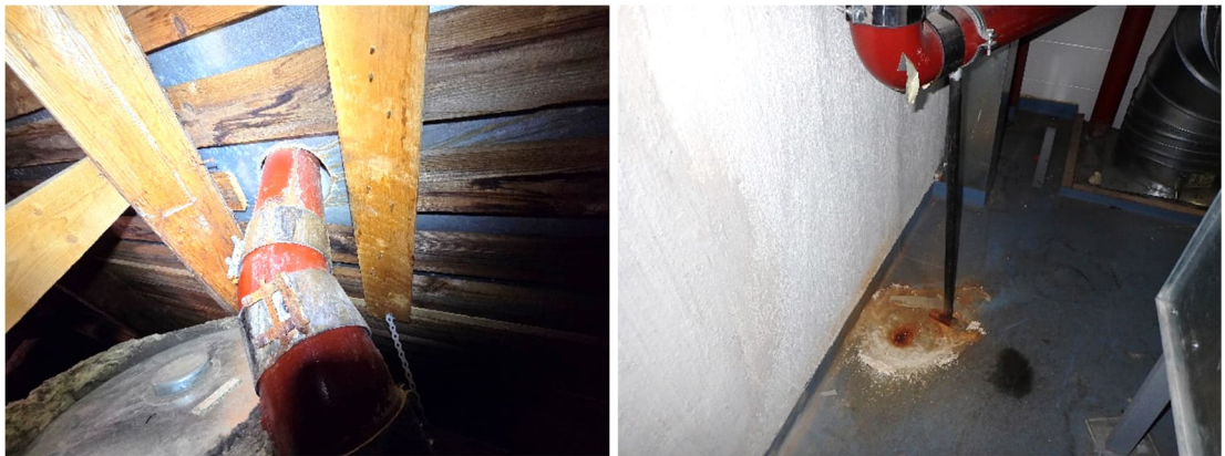
Kuvat 255 ja 256. Ullakon 503 ja ilmanvaihtokonehuoneen 413a ruostuneet viemärin tuuletusputket.
