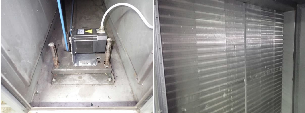
Kuvat 303 ja 304. Yleiskuvat LTO:n moottorista, joka on ilmanvaihtokoneeseen jälkikäteen uusittu, sekä lämmityspatterista, joka oli silmämääräisesti tarkastelun perusteella puhdas ja hyväkuntoinen.
