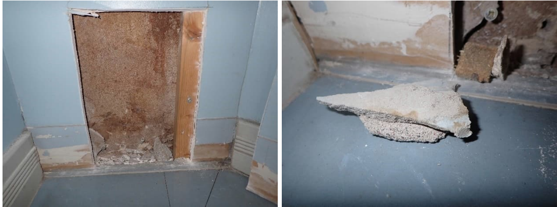
Kuvat 107 ja 108. Aulan 415 pienialaisesti levytetyn ulkoseinän avaus R49. Levytyksen takana oleva rappauspinta oli epämääräisen värinen ja koolausvälissä oli mm. irtonaisia rappauspaloja, joissa oli kosteusjälkiä.
