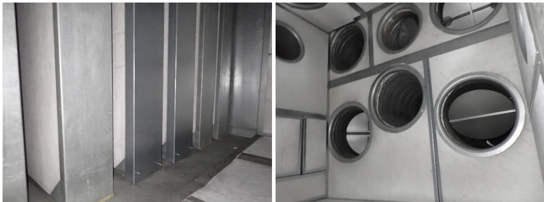
Kuvat 307 ja 308. Yleiskuvat äänenvaimennusosan äänenvaimennuskaseteista ja tuloilmakammion äänenvaimennuksista. Osat olivat hyväkuntoiset ja puhtaat. Silmämääräisen arvion perusteella äänenvaimennusmateriaalit eivät ole alkuperäiset.
