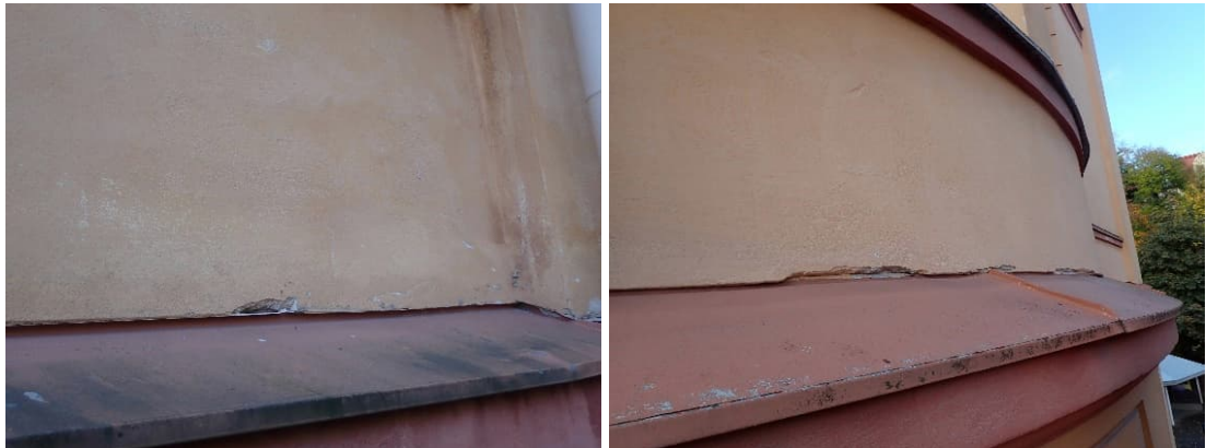
Kuvat 77 ja 78. Rappauksen yksittäisiä vaurioita pellitysten ylösnostojen kohdilla. Tällaisia vaurioita esiintyi enemmän sisäpihan puoleisilla julkisivuilla.
