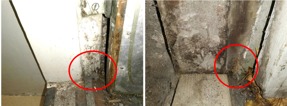
Kuvat 133 ja 134. Wc-tilojen 036 ja ryömintätilan ovien karmit olivat lahonneet merkittävästi alareunastaan.
