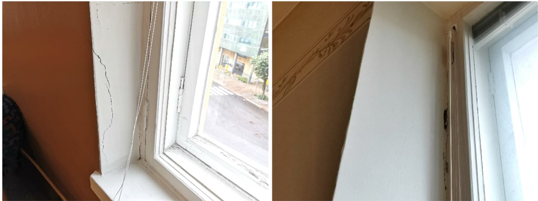
Kuvat 110 ja 111. Kirjaston tilojen 315 ja 314 ikkunaliittymissä havaittiin muita tiloja isommat halkeamat, ja halkeamien kautta todettiin ilmavirtausta huoneen suuntaan. Tilan 315 pielen halkeamasta todettiin myös ilmavirtausta.
