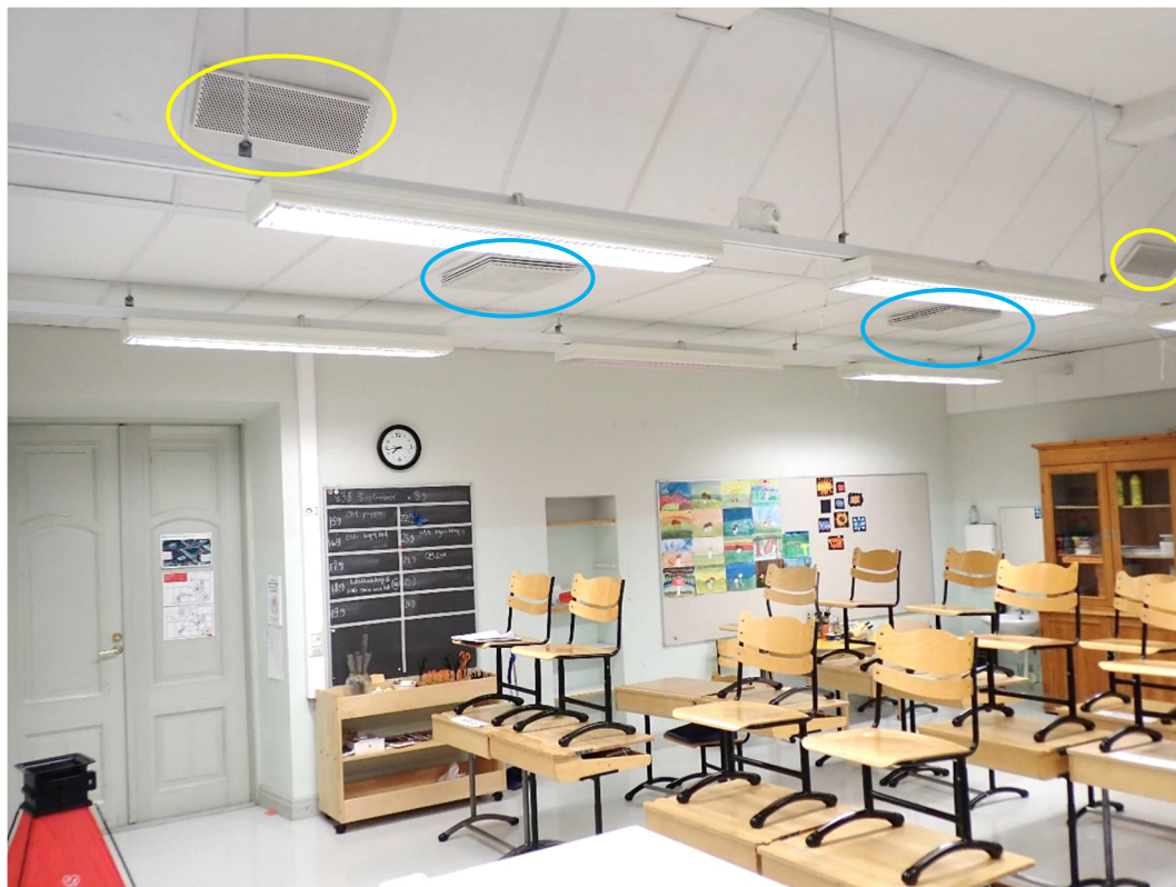
Kuva 341. Yleiskuva luokkatiloissa yleisesti käytetystä ilmajaosta. Tuloilmalaitteet on sijoitettu katon alalaskun alapintaan lähelle käytäväseinustaa (korostettu sinisellä merkinnällä) ja poistoilmalaitteet katon alalaskun viistepinteen hieman kesemmäksi luokkatilaa (korostettu keltaisella merkinnällä).
