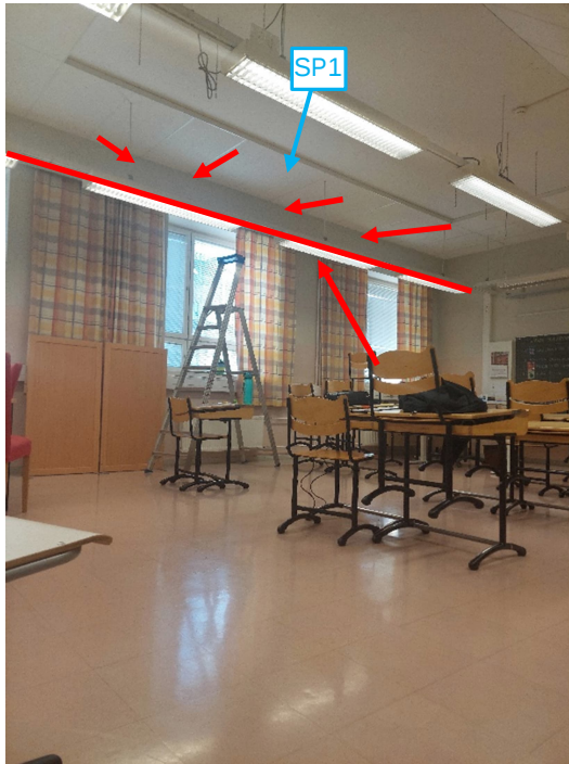
Kuva 238. Merkkiainekokeessa MA8 havaitut ilmapuotopaikat on merkitty punaisilla nuolilla. Jatkuva vuotokohta on esitetty kuvassa punaisella viivalla. Kaasun arvioitu syöttöpiste yläpuolisen luokan puolella on merkitty sinisellä nuolella.
