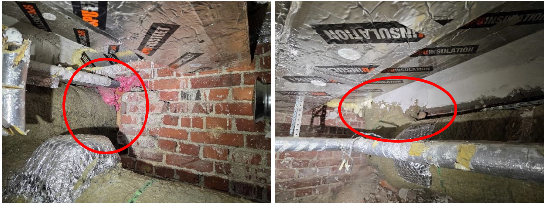
Kuvat 21 ja 22. Ryömintätilassa kulkee tekniikka ja niiden läpivientejä ylöspäin ja sivusuuntaan.
