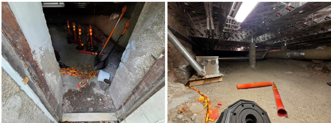
Kuvat 23 ja 24. Maanpinta oli märkää ryömintätilan oven edustalla, muuten ei havaittu viitteitä tilaan kulkeutuvasta vedestä.
