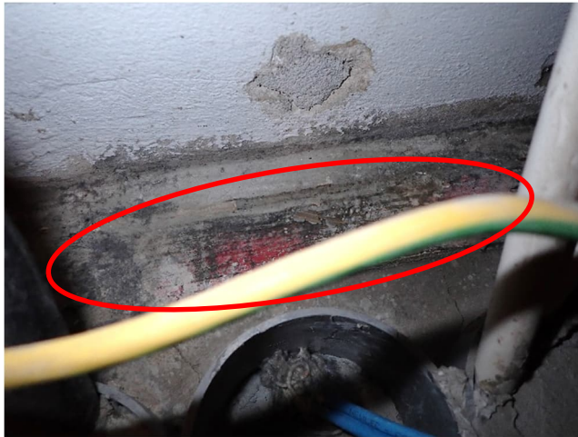
Kuva 162. Alkuperäisen osan kolmannen kerroksen sähkökeskuksen lattiassa havaittiin mustaa asbestipitoista liimaa.
