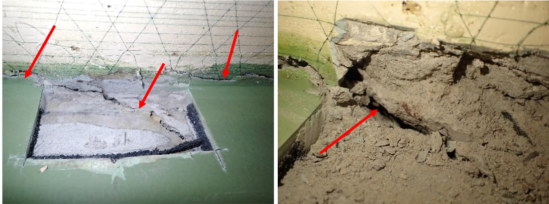
Kuva 53 ja 54. Teknisentyöluokan 001 lattian avaus R21. Alapohjan pintalaatassa on iso halkeama seinän vierellä ja sieltä keskemälle. Myös maanvastaisen seinän rappauksen alta virtasi ilmaa (oikeanpuoleinen kuva, nuoli).
