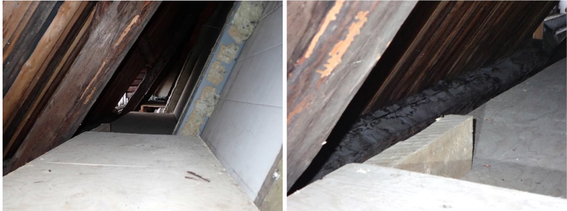
Kuvat 257 ja 258. Ilmaväli ilmanvaihtokonehuoneen 413a ja vesikaton pystyosan välillä. Rakenteissa näkyi kosteusjälkiä.
