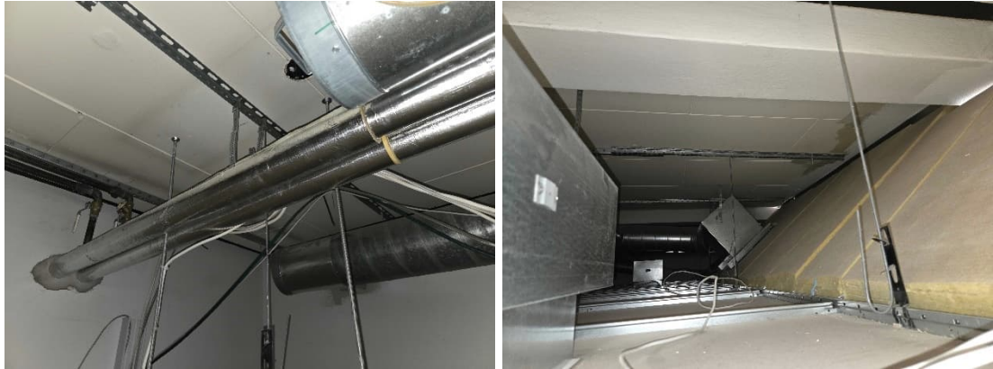
Kuvat 203 ja 204. Luokan 108 avauksessa R4 ei tehty erityisiä välipohjaan liittyviä havaintoja. Vinon alakaton mineraalivillojen reunapinnat olivat käsittelemättä.
