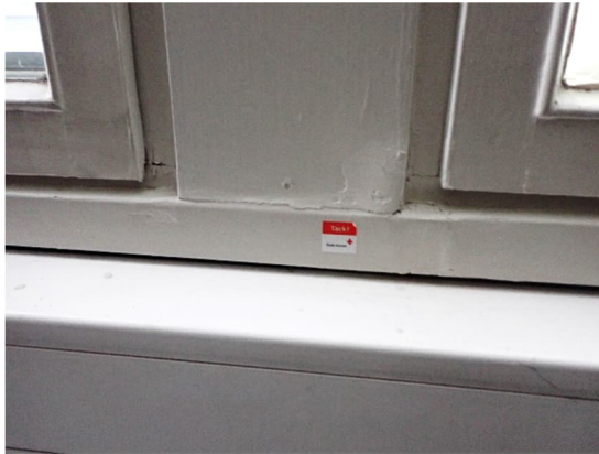
Kuva 112. Alkuperäisen osan neljännen kerroksen ikkunoiden välissä olevien levytysten alta virtasi ilmaa huoneen suuntaan ja ilman mukana havaittiin tulevan PAH-yhdisteiden hajua.
