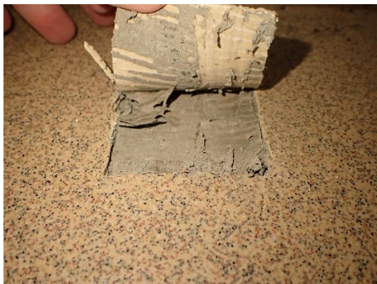
Kuva 37. Keittiön 017 mittapiste V9. Kohdassa suhteellinen kosteus oli koholla rakenteen matalan lämpötilan vuoksi. Maton alla aistittiin lievää kemiallista hajua.
