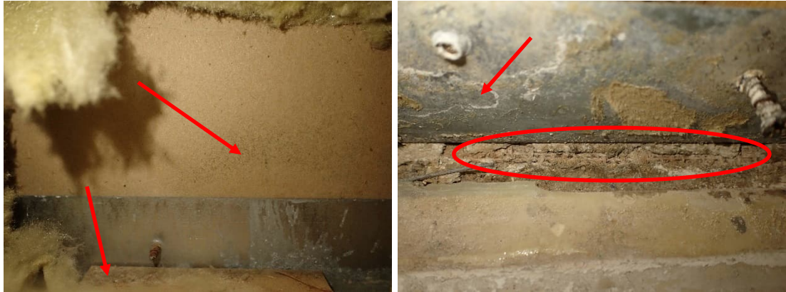
Kuvat 145 ja 146. Wc-tilojen 205-207 edustan väliseinän avaus R41. Seinässä oli kosteusjälkiä alumiinirungossa ja rungon päällä olevassa vanerissa sekä tummentumaa kipsilevyjen taustapinnoilla (nuolet). Seinän alla havaittiin jäämiä vanhasta linoleum-matosta (soikio).
