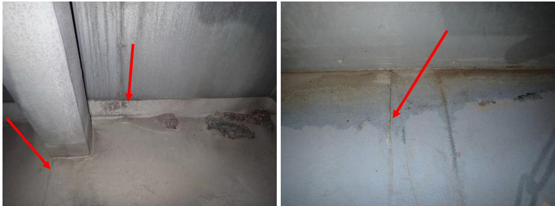
Kuvat 294 ja 295. Ulkoilmakammion muovimaton ylösnosto oli epätiivis, lisäksi kammion sekä konehuoneen 410 muovimattojen saumoja oli auki. Konehuoneen lattialla oli näkyvää kosteutta muovimaton päällä ja kosteus muovimaton alla oli myös korkea.
