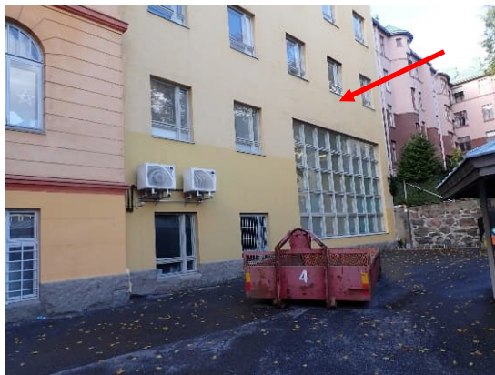
Kuva 84. Laajennusosan alaosan huoltomaalaus erottui muusta julkisivusta erivärisenä. Eristerappautusta on ison ikkunan yläpuolisella osuudella (nuoli).
