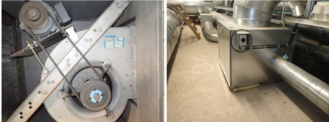
Kuvat 313 ja 314. Yleiskuva tuloilmapuhaltimesta, sekä ullakkotilassa olevasta poistoilmapuhaltimesta.
