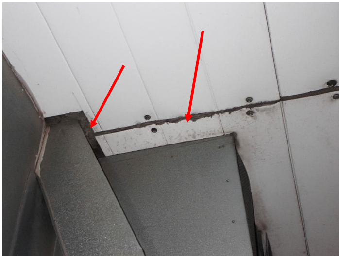
Kuva 296. Ulkoilmakammion peltielementtien saumoissa ja liittymissä oli näkyvillä mineraalivillaa.
