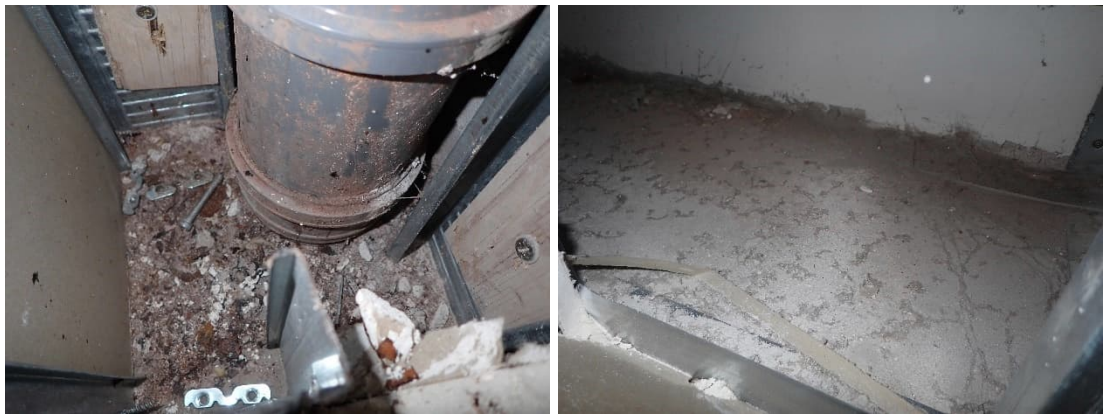
Kuvat 63 ja 64. Alapohjaan rajautuvien koteloitien avaukset R23 ja R70 tiloissa 003 ja 040. Avauksen R23 koteloinnin sisällä oli runsaasti roskaa. Alapohjan läpiviennistä ei todettu ilmavirtausta. Koteloinnin R70 sisällä ei ollut läpivientejä alapohjaan. Pohjalla ei todettu koholla olevia pintakosteusilmaisimen arvoja.
