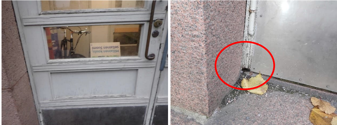
Kuvat 129 ja 130. Laajennusosan kadunpuolen ulko-oven maalipinta oli ulkopuolelta heikossa kunnossa ja lasituslistat olivat haristuneet. Karmin alareuna oli paikallisesti lahonnut.
