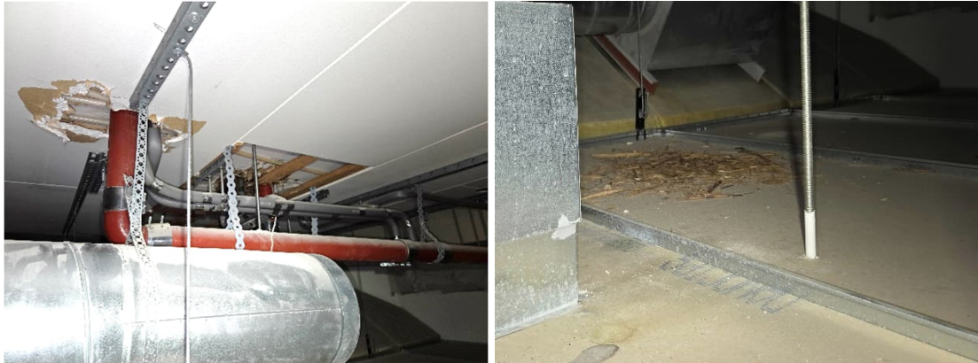
Kuvat 199 ja 200. Tilan 105 avauksen R20 kohdalla oli epätiivitä läpivientejä, ja alakaton päälle oli pudonnut välipohjan järviruokoeristettä.
