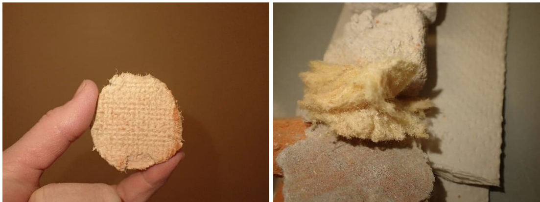
Kuvat 105 ja 106. Laajennusosan vanhojen patterisivyennysten alkuperäisenä eristeenä oli ohut huokoinen puukuitulevy (vasemmanpuoleinen kuva tilan 213 avauksesta R40) ja luokan 403 kohdalla oli muista poiketen sisäpuolen kahi-tiilimuurauksen takana lisäksi ohut mineraalivillalevy (avaus R47).
