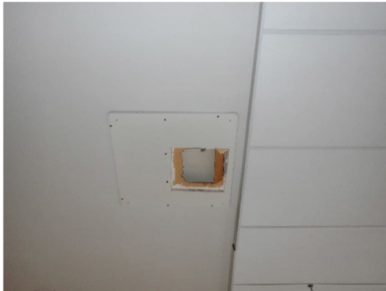
Kuva 277. Luokan 417 kiinteän alakaton kohdalla oli kaksi ruuvein ja liimalla kiinnitettyä levyä, joista toiseen tehtiin avaus R53. Levyn takana oli ehjää alkuperäistä rappausa.
