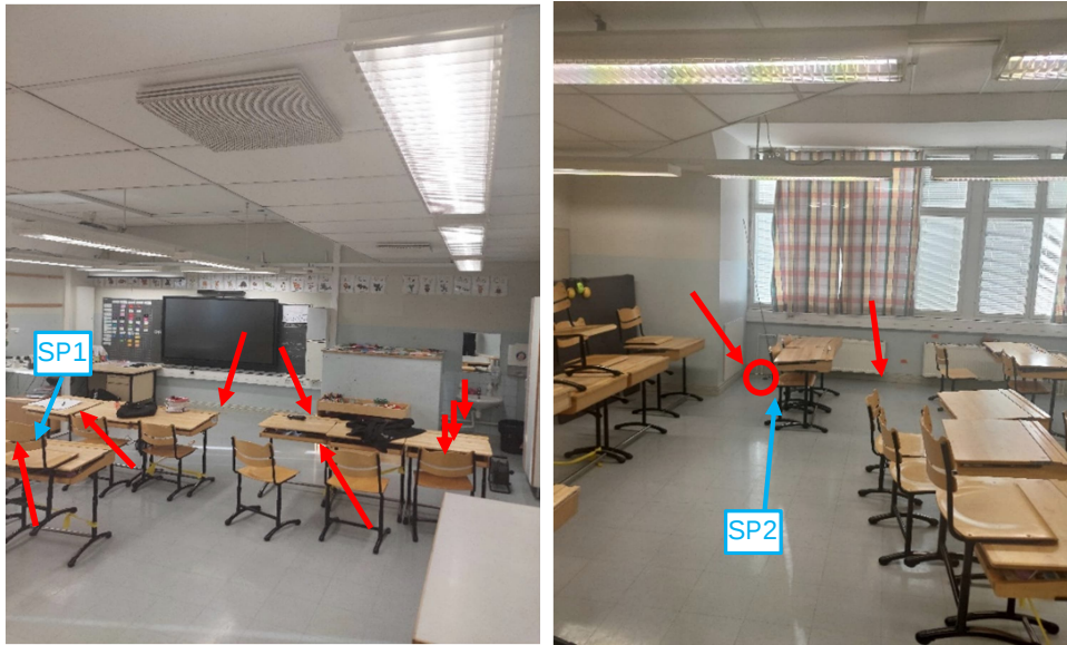
Kuvat 233 ja 234. Luokan 417 merkkiainekokeessa MA7 havaitut ilmavuotopaikat ennen jalkalistojen tiivistysten raottamista on merkitty punaisilla nuolilla ja ympyröillä (lämpöjohtojen läpivienti). Kaasun syöttöpisteet (SP) on merkitty sinisillä nuolilla.
