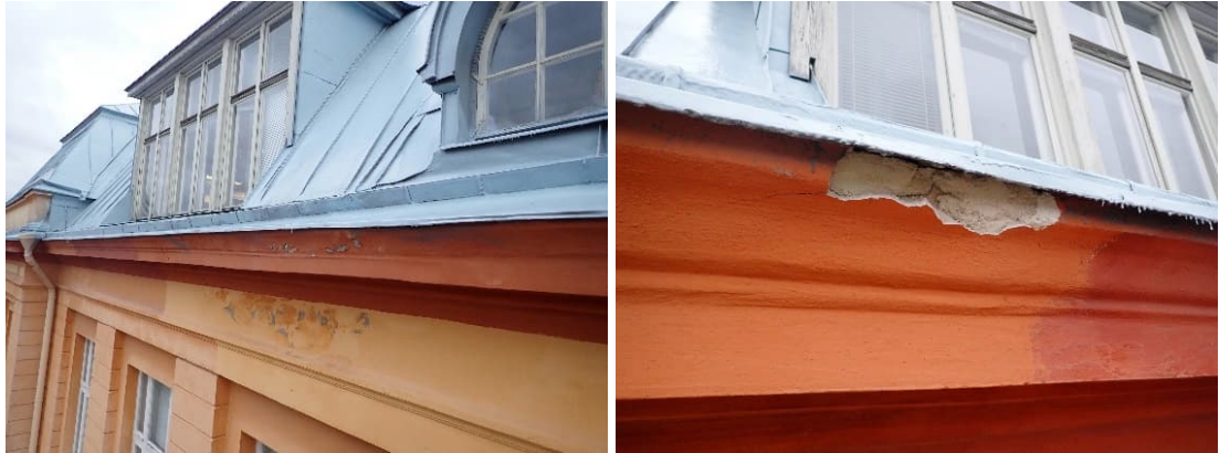
Kuvat 71 ja 72. Rakennuksen räystäällä esiintyviä rappauksen ja pinnoitteen vaurioita. Vaurioita esiintyi myös jo korjatuilla osuuksilla (vaurioiden aiheuttajaa ei ole korjattu). Kuvat katujulkisivuilta. Vasemmanpuoleinen kuva on luokan 417 sivuvintin kohdalta kohdasta, jossa ulkoseinässä todettiin poikkeavaa kosteutta.
