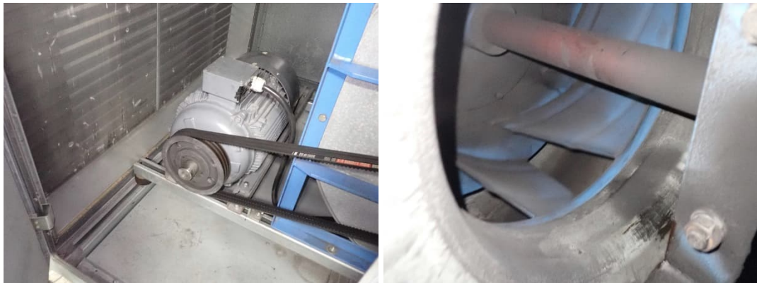
Kuvat 305 ja 306. Yleiskuvat tuloilmapuhaltimen moottorista ja tuloilmapuhaltimen siivistä. Osat olivat silmämääräisen tarkastelun perusteella tyydyttävässä kunnossa, eikä merkittävää likaantumista havaittu. Vastaavat havainnot tehtiin poistopuhaltimen ja sen moottorin osalta.
