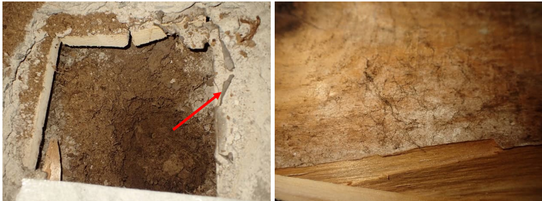
Kuvat 261 ja 262. Laajennusosan yläpohjan avaus R59, jossa muottilaudassa havaittiin tummia pisteitä ja tummaa rihmastoa. Yläpohjan tervapaperi (nuoli) ei sisältänyt asbestia, mutta se sisälsi PAH-yhdisteitä.
