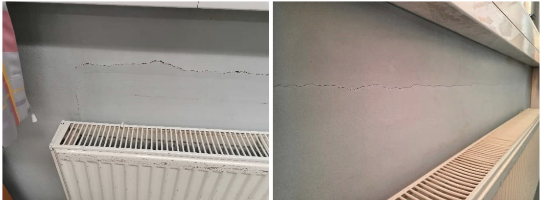
Kuvat 103 ja 104. Laajennusosan vanhat patterisivyennykset on tasattu kahi-tiilimuurauksella muun seinäpinnan tasoon. Muurauksen reunalla on usean ikkunan alla halkeamat.
