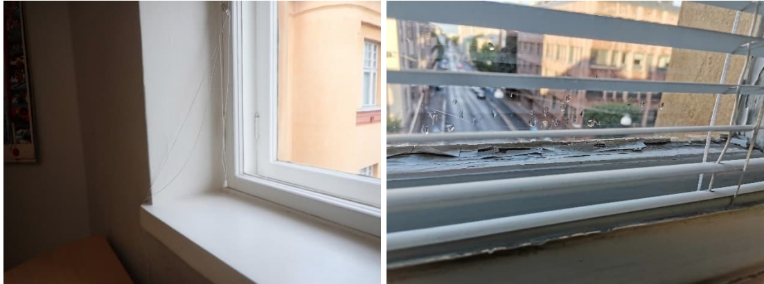
Kuvat 115 ja 116. Laajennusosan ikkunoiden lasivälit olivat vaihtelevassa kunnossa.
