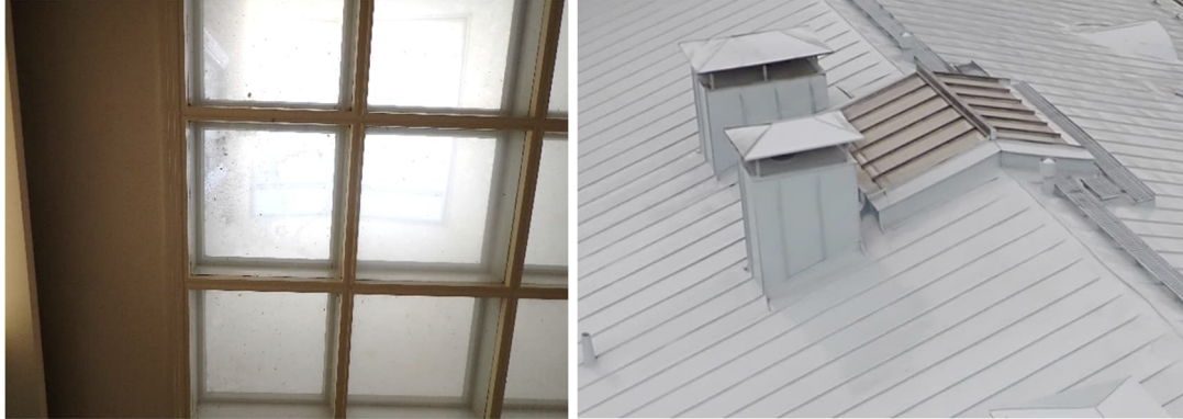
Kuvat 125 ja 126. Laajennusosan neljännen kerroksen kattoikkunat ovat likaiset ja vesikaton puoleisista lasista kahdessa havaittiin halkeama.
