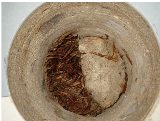
Kuva 186. Aulan 415 välipohjan avaus R48. Avauksessa havaittiin mikrobiperäistä hajua ja eristeessä todettiin mikrobikasvustoa.
