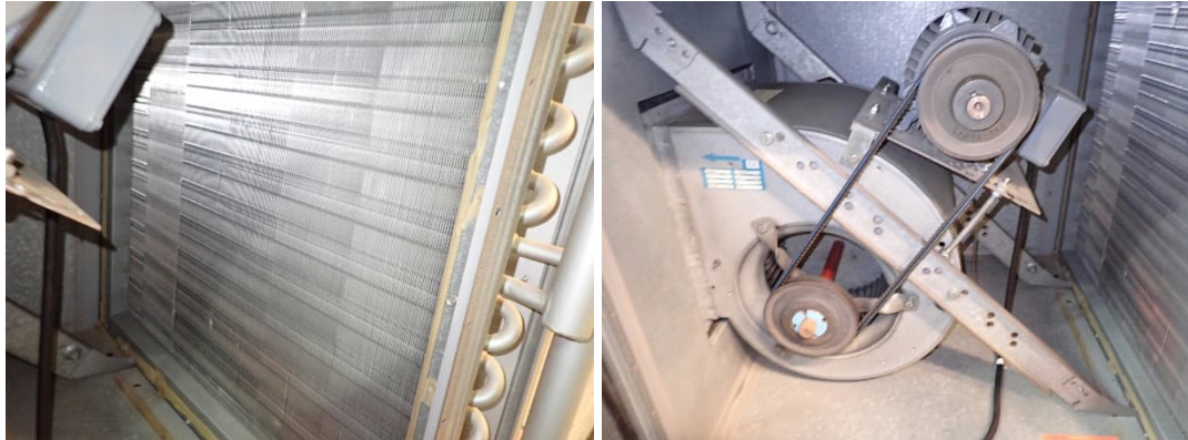
Kuvat 331 ja 332. Yleiskuvat lämmityspatterista ja tuloilmapuhaltimesta. Osissa ei havaittu aistinvaraisen tarkastelun perusteella puutteita. Huomioiden myös poistoilmapuhallin.
