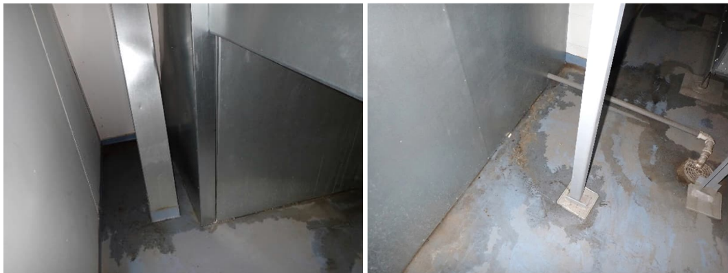
Kuvat 169 ja 170. Ilmanvaihtokonehuoneen 410 lattialla oli runsaasti kosteusjälkiä raitisilmasäleikköjen lähistöllä sekä lattiassa että seinän pellityksessä.
