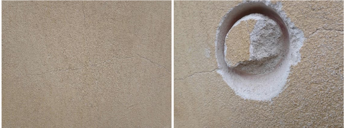
Kuvat 82 ja 83. Laajennusosalla oli havaittavissa melko paljon ohutta rappauspinnan halkeilua. Tehdyn rakenneavauksen perusteella halkeamat eivät kuitenkaan ulotu koko rappauserroksen läpi, vaan ovat vain pintakerroksessa.
