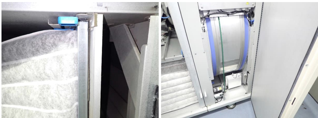
Kuvat 333 ja 334. Yleiskuvat ulkoilman suodattimesta ja LTO:sta. Suodatinkehys on varustettu lukituksella, mutta kehyksen tiiviste on pakoin kulunut pois. LTO on silmämääräisten havaintojen perusteella hyväkuntoinen.
