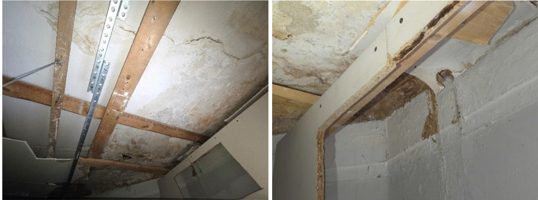
Kuvat 219 ja 220. Tilan 321 avauksen R14 kohdalla välipohjan rappauksessa havaittiin laajalti vanhoja kosteusjälkiä ja rappauksen irtoilua ja vanhat epätiivit lämpöjohtojen läpiviennit.
