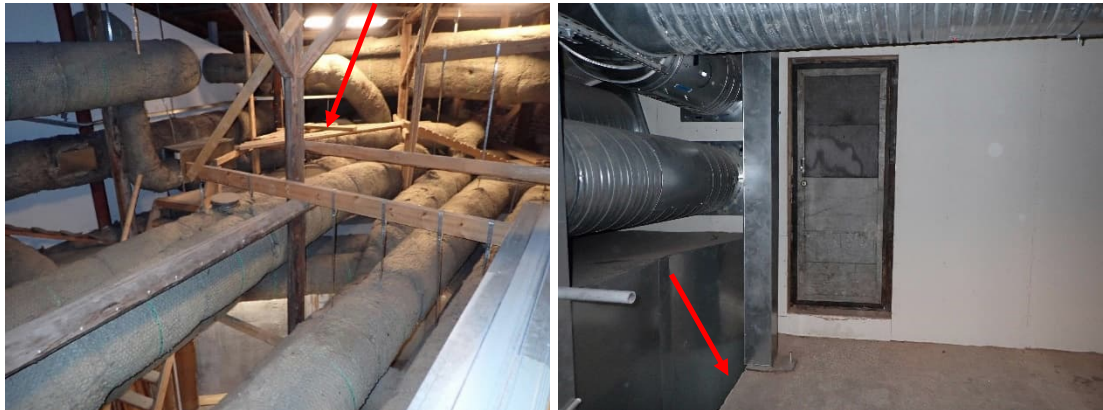
Kuvat 249 ja 250. Vasemmanpuoleisessa kuvassa on kulkusilltaa korkealla ullakkotilassa 413, sillalta puuttuu kaiteet. Oikeanpuoleisessa kuvassa on ullakkotilan 501 oviaukko, ovelle vievältä tasanteelta on pudotus ilmanvaihtokonehuoneeseen 413a, tasanteelta puuttuu kaide.
