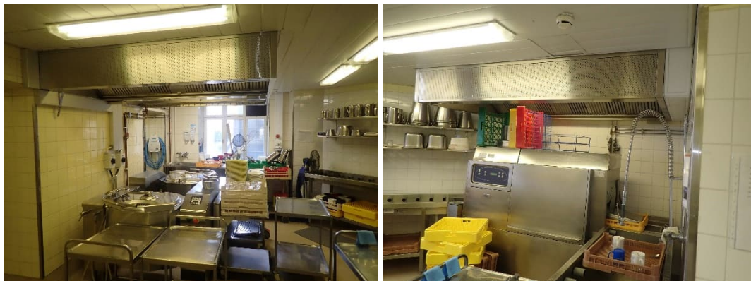
Kuvat 362 ja 363. Yleiskuvat keittiön rasva- ja kondenssihuuvista.
