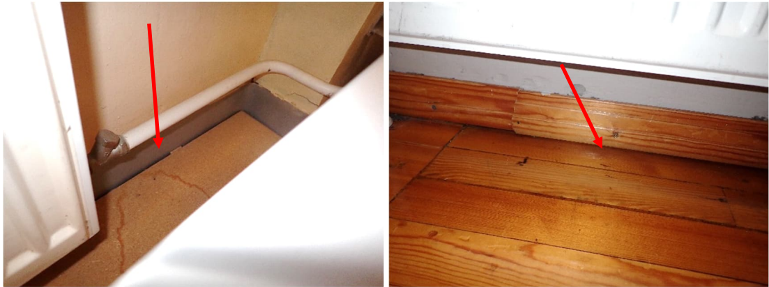
Kuvat 45 ja 46. Teknisentyön luokan 001 sekä liikuntasalin 127 lattioiden ja ulkoseinien liittymistä todettiin ilmavirtausta huonetilojen suuntaan. Liikuntasalin 127 ilmavuodon mukana aistittiin tulevan voimakasta PAH-yhdisteiden hajua.
