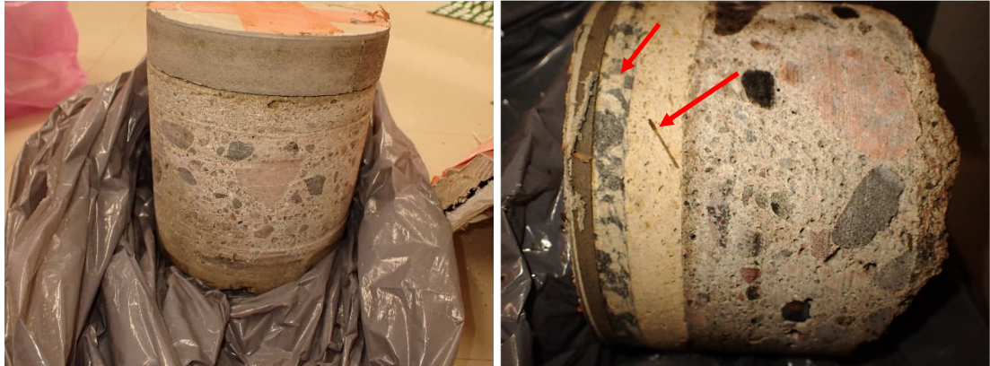
Kuvat 184 ja 185. Tilan 216 välipohjan avaus R38 vasemmanpuoleisessa kuvassa ja oikealla luokan 225 välipohjan avaus R39, jossa todettiin kaksi kerrosta asbestia sisältävää magnesiassa (nuolet). Lisäksi rakenteessa oli asbestia sisältävää mustaa liimaa.
