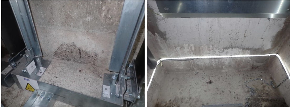
Kuvat 41 ja 42. Hissikuilussa oli voimakas mikrobiperäinen haju. Seinien alaosissa todettiin koholla olevia arvoja pintakosteusilmallisella.
