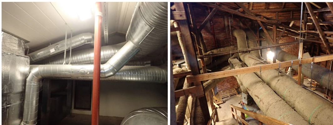
Kuvat 342 ja 343. Yleiskuvat ilmanvaihtokanavista ilmanvaihtokonehuoneessa ja ullakkotilassa. Ullakko- ja alapohjatilan kautta kulkevat ilmanvaihtokanavat ovat paloeristetty.
