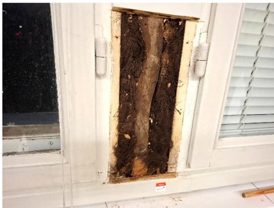
Kuva 109. Neljännen kerroksen ikkunoiden välin rakenne luokan 417 avauksessa R64. Rive sisälsi PAH-yhdisteitä.
