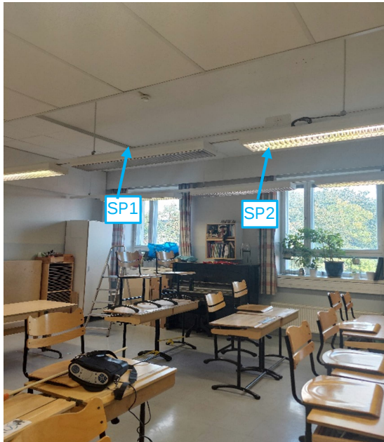
Kuva 285. Luokan 401 merkkiainekokeen MA10 kaasun syöttöpisteiden suuntaa antavat sijainnit ullakon puolella on merkitty sinisellä nuolella. Yläpohjasta ei todettu ilmavuotoa.
