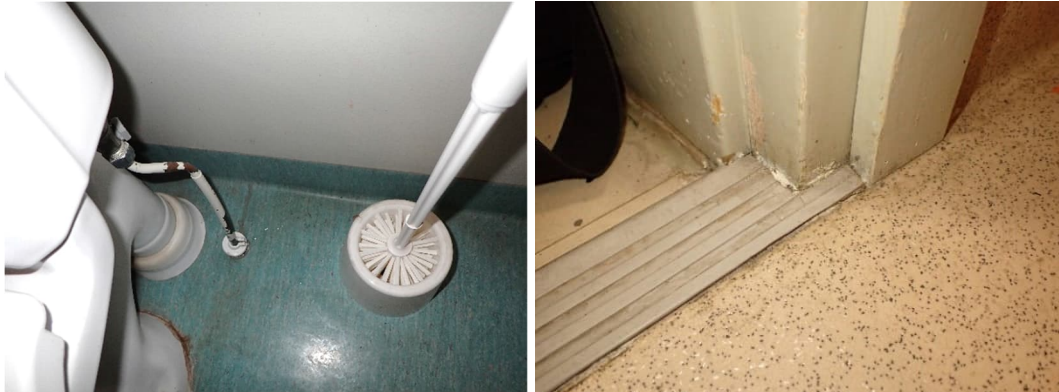
Kuvat 167 ja 168. Wc-tilan (varaston 116 takana sijaitseva) wc-istuimen vesijohto vuosi lattialle ja wc-tilojen 205 ja 206 muovimattojen kynnyksiin olivat epätiivitä.
