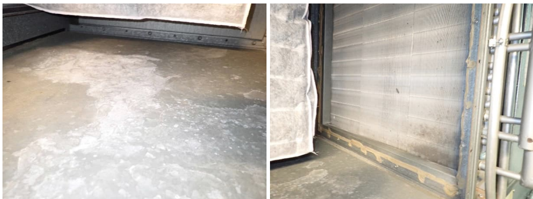
Kuvat 311 ja 312. Yleiskuvat ulkoilman suodatinosan pohjasta, missä havaittiin vanhoja kosteusjälkiä, ja lämmityspatterista. Lämmityspatterin huoltoluukun puoleisessa laidassa havaittiin likakertymää.
