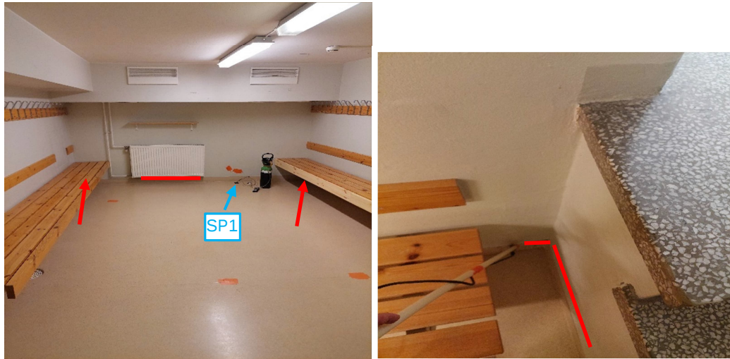
Kuva 50 ja 51. Pukuhuoneen 041 merkkiainekokeessa MA3 havaitut ilmavuotopaikat on merkitty punaisella viivalla (yhtenäinen vuotokohta) ja punaisilla nuolilla (pistemäiset vuotokohdat). Kaasun syöttöpiste on merkitty sinisellä nuolella.
