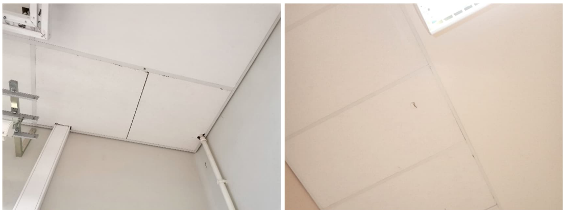
Kuvat 179 ja 180. Kattojen mineraalivillalevyjen leikkauspinnat olivat käsittelemättä ja levyjen pinnoissa oli yksittäisiä pienialaisesti rikkoutuneita kohtia.
