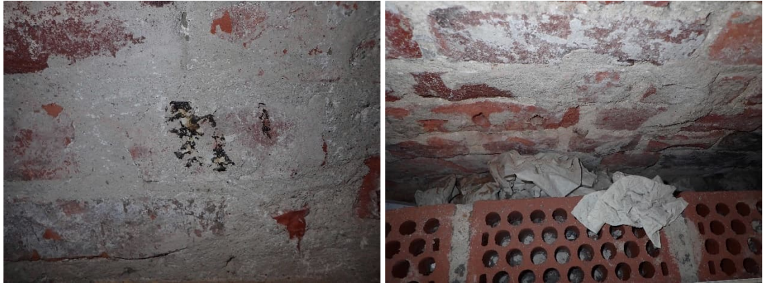
Kuvat 97 ja 98. Ruokailutilan 029 luukun R62 kohdalla seinässä oli hieman pikisivelyä ja luukun R63 lukitusmekanismi puuttui, joten luukun takana oli enemmän roskaa kuin muualla.
