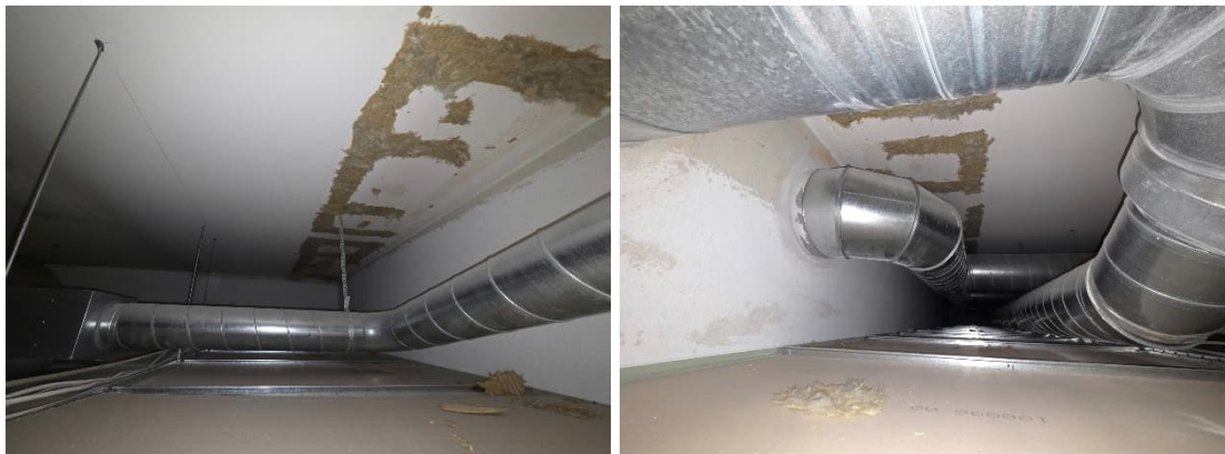
Kuvat 282 ja 283. Luokan 403 avauksessa R11 alaslaskun yläpuolella katossa havaittiin jälkiä ja mineraalivillajäämiä, jotka viittaavat vanhojen yläpohjaan liimattujen akustiikkalevyjen poistoon.
