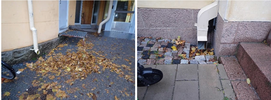
Kuvat 4 ja 5. Kattovedet on johdettu alas syöksytorvin, jotka laajennusosan puolella on upotettu ulko-seinärakenteeseen (oikeanpuoleinen kuva), ja niistä edelleen sadevesijärjestelmään.
