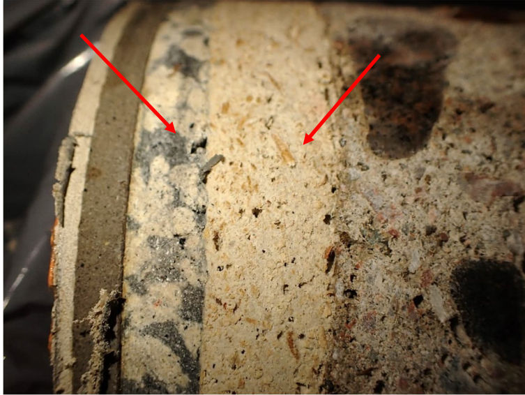
Kuva 161. Asbestia sisältävät magnesiamassakerrokset luokan 225 lattian avauksessa R39.
