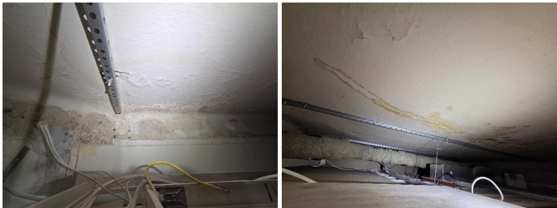
Kuvat 205 ja 206. Käytävän 122 avauksessa R1 havaittiin laajalti maalipinnan hilseilyä ja vanhoja kosteusjälkiä.
