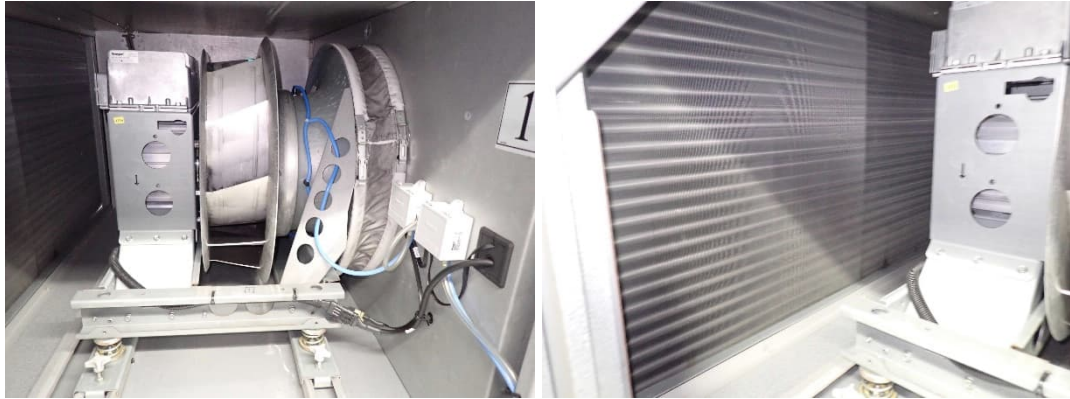
Kuvat 335 ja 336. Yleiskuvat ilmanvaihtokoneen puhaltimesta (tulo) ja lämmityspatterista. Komponentit olivat silmämääräisen tarkastelun perusteella siistit ja hyväkuntoiset.
