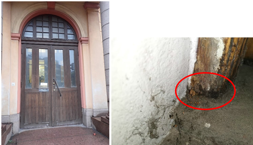
Kuvat 127 ja 128. Alkuperäisen osan kadunpuoleinen ulko-ovi. Karmissa oli hieman lahoa sisäpuolella.
