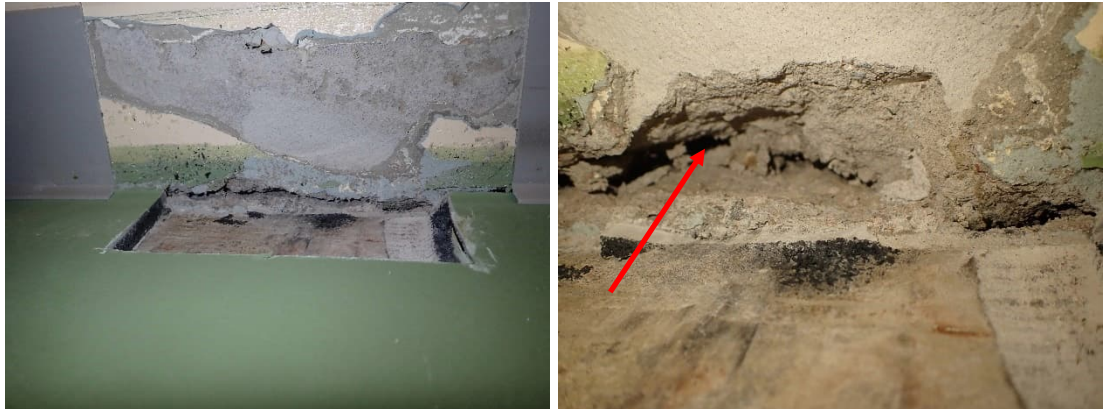
Kuva 55 ja 56. Teknisentyöluokan 001 lattian avaus R22. Alapohjan pintalaatassa on iso halkeama seinän vierellä. Myös maanvastaisen seinän rappauksen alta virtasi ilmaa (oikeanpuoleinen kuva, nuoli).
