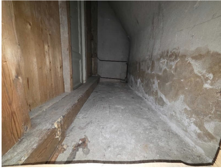
Kuva 92. Luokan 417 sivuvintin ulkoseinää, jossa oli havaittavissa selkeitä kosteusjälkiä ja koholla olevia pintakosteusilmaisimen arvoja.
