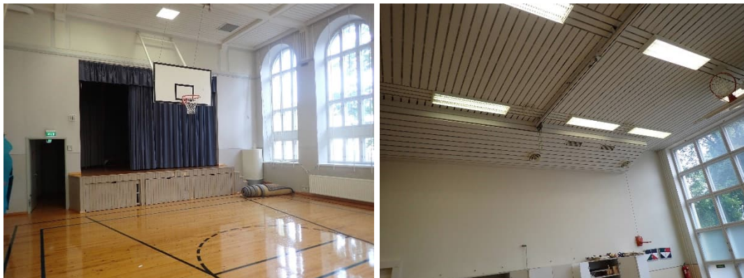
Kuvat 364 ja 365. Yleiskuvat uuden 127 ja vanhan liikuntasalin 001 päätelaitteista. Uudessa salissa tuloilmalaitteet ovat lattiatason lähellä olevia piennopeuslaitteita, vanhassa kattoasenteisia hajottajia. Molempien tilojen osalta poistoilmalaitteet ovat säleiköitä.
