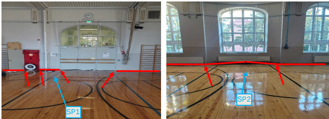
Kuva 47 ja 48. Liikuntasalin 127 alapohjan merkkiainekokeen MA1 havaitut ilmavuotopaikat on merkitty punaisella viivalla (jalkalistojen takaa laaja-alaiset merkittävät vuodot) ja punaisilla nuolilla (paikallisemmat merkittävät vuodot). Kaasun syöttökohdat (SP) ryömintätilan puolella on merkitty sinisillä nuolilla suuntaa antavasti.
