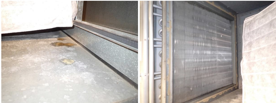
Kuvat 317 ja 318. Yleiskuvat ulkoilman suodatinosan pohjasta, missä havaittiin kosteusjälkiä ja lämmityspatterista. Lämmityspatterin huoltoluukun puoleisessa laidassa havaittiin hieman likakertymää.
