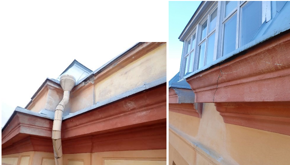
Kuvat 73 ja 74. Katujulkisivulla olevaa rakennuksen julkisivun yläosaa ei ole korjattu (huoltomaalattu) samanaikaisesti muun julkisivun kanssa. Yläosan pinnoite oli selvästi kuluneempi kuin muulla julkisivulla. Räystäällä oli isompi halkeama sisäpihan julkisivulla.
