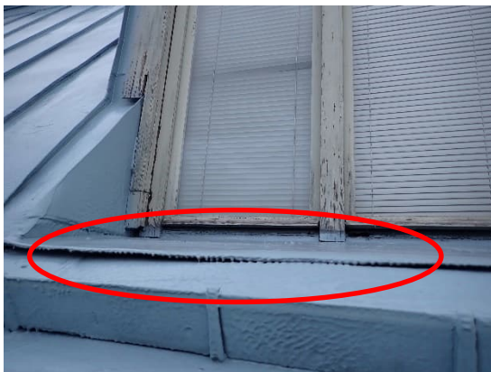
Kuva 244. Peltikatteen pinnoituksen valumaa ikkunan alapuolella.
