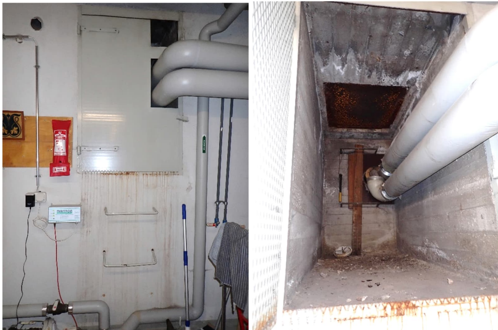
Kuvat 99 ja 100. Kaukolämpötilan 027 maanvastaisella ulkoseinällä oleva betonitunneli ja sen katon peltiluukku. Tunnelin betonipinnoilla todettiin kohonneita pintakosteusilmaisimen arvoja ja luukun alla oli valumajälkiä.
