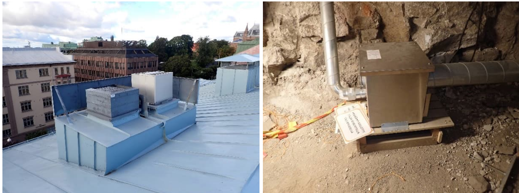
Kuvat 339 ja 340. Yleiskuvat vesikatolla olevista huippuimureista (20PK ja 12PK1), sekä ryömintätilassa olevasta ilmankuivaimesta. Huippuimuri 12PK1 ja ilmankuivain olivat silmämääräisten havaintojen perusteella muita erillispoistopuhaltimia uudempia arviolta 2010-luvulta.
