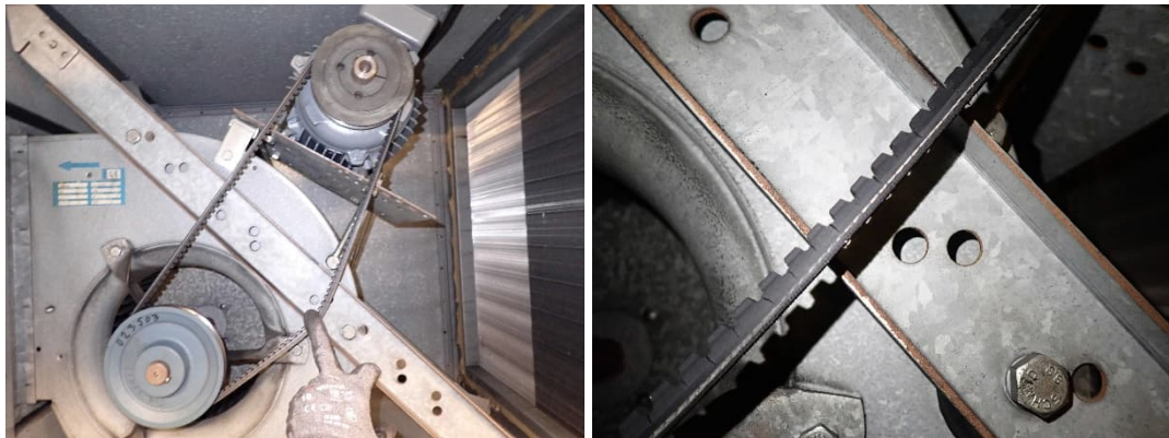
Kuvat 319 ja 320. Yleiskuva tuloilmapuhaltimesta. Tuloilmapuhaltimen hihnan havaittiin olevan poikkeavan löysällä, sekä itse hihnan olevan heikkokuntoinen.
