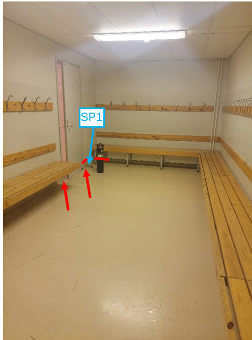
Kuva 52. Pukuhuoneen 003 merkkiainekokeessa MA13 havaitut pistemäiset ilmavuotopaikat on merkitty punaisilla nuolilla. Punaisella viivalla on merkitty väliseinän ja maanvastaisen seinän alapohjaliittymät, joista todettiin vuotoa, kun muovimaton ylösnostoa raotettiin. Kaasun syöttöpiste on merkitty sinisellä nuolella.
