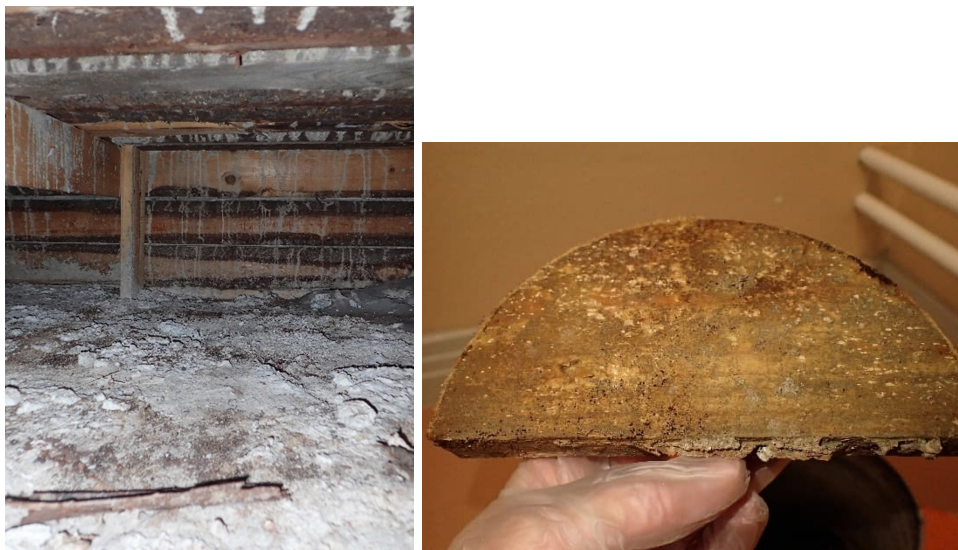
Kuvat 189 ja 190. Tilan 213 välipohjan avaus R37. Muottilautoissa havaittiin näkyvää mikrobikasvustoa.
