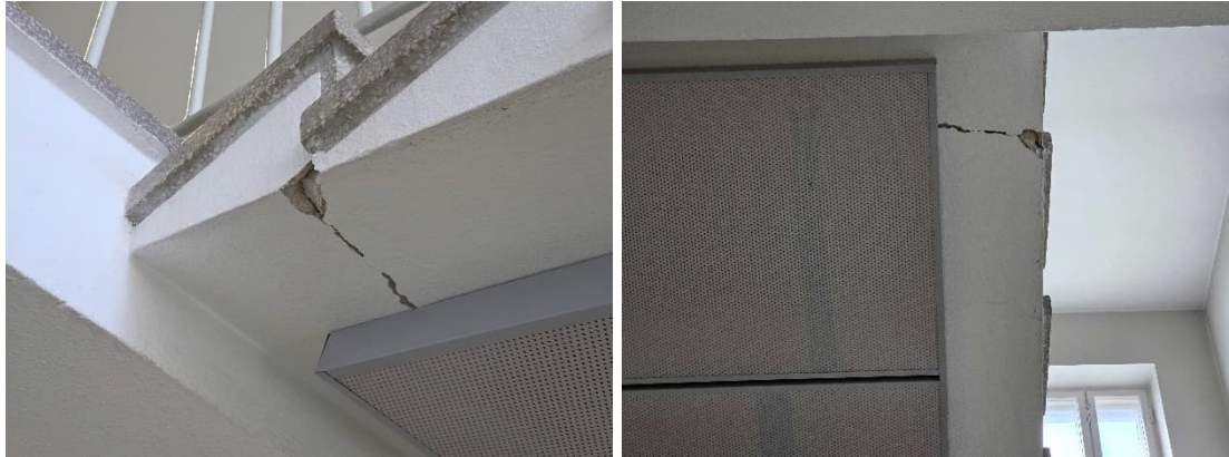
Kuva 165 ja 166. Merkittävä halkeama laajennusosan porrashuoneessa 407 ylimmän portaan alla.
