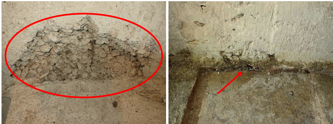
Kuvat 43 ja 44. Hissikuilun alapohjan ja seinien välissä havaittiin useita ilmapuotokohtia, joita on havainnollistettu kuvissa.
