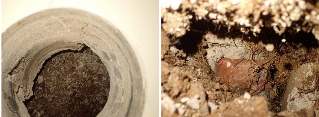
Kuvat 187 ja 188. Luokan 101 välipohjan avaus R36. Välipohjassa oli muista poiketen turve-eriste ja siinä todettiin mikrobikasvustoa.
