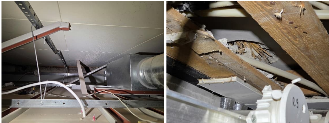
Kuvat 201 ja 202. Käytävän 108 avauksessa R2 oli alaslaskun takana vanha ehjä kipsilevyalaslasku ja avauksessa R3 vanhaa kattoa oli avattu ja välipohjassa oli epätiivis läpivienti, josta näkyi välipohjan eristettä.
