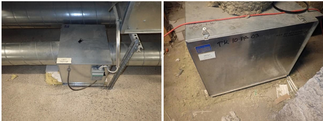
Kuvat 337 ja 338. Yleiskuvat ilmanvaihtokonehuoneissa ja ullakkotiloissa olevista poistoilmapuhaltimista PK21 (vasen kuva) ja 10PK3 (oikea kuva).
