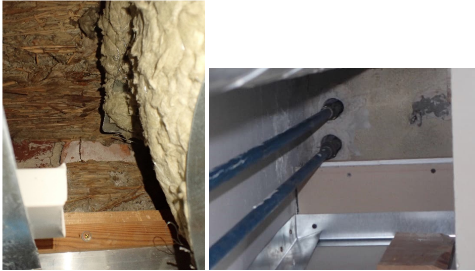
Kuvat 227 ja 228. Kotelointien sisällä näkyvää välipohjan järviruokoeristettä (liikuntasalin varaston avaus R30) ja epätiivit välipohjan läpiviennit (pukuhuoneen 040 avaus R70).
