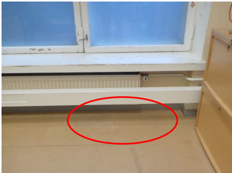
Kuva 40. Kosteusjälkiä teknisentyön luokan lattiassa ulkoseinän vierellä patterin edustalla.
