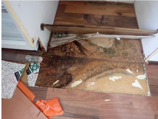
Kuva 102. Välipohjarakenteissa havaittiin vesivahinkoalue asunnon 7 keittiössä.
