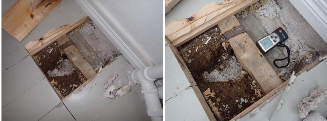
Kuvat 129 ja 130. Rakenneavaus R18 VP asunnon 1 makuuhuone. Rakenneavauksesta otettiin näyte N17 (turve, kutteri) mikrobialyysiin. Suoramikroskooppinnin perusteella näytteessä on sienikasvusto.
