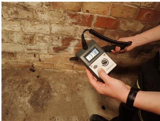
Kuva 56. Maanvastaisissa seinärakenteissa havaittiin monin paikoin vertailuarvoista poikkeavia pintakosteudenosoittimen lukemia noin metrin korkeudelle saakka lattiapinnasta.
