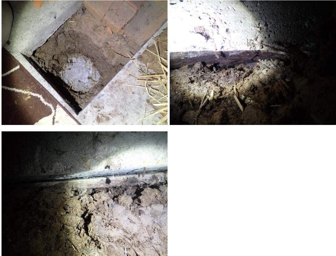
Kuvat 176, 177 ja 178. Rakenneavaus R7 YP. Rakenneavauksesta otettiin näyte N7 (turve) mikrobi-analyysiin. Näytteessä ei esiinny mikrobikasvustoa.
