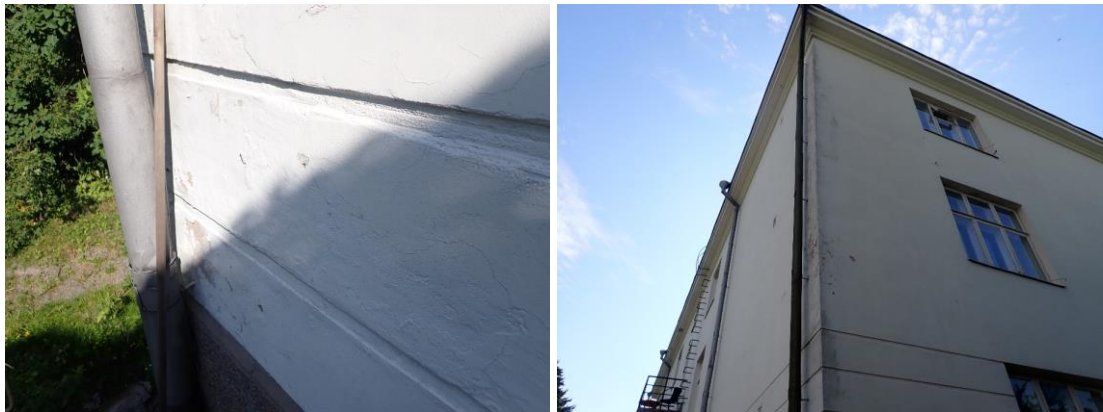
Kuvat 149, 150, 151 ja 152. Syöksytorvissa on vesitiiviys- ja kiinnityspuutteita. Syöksytorvet lisäävät julkisivun kosteusrasitusta paikallisesti.
