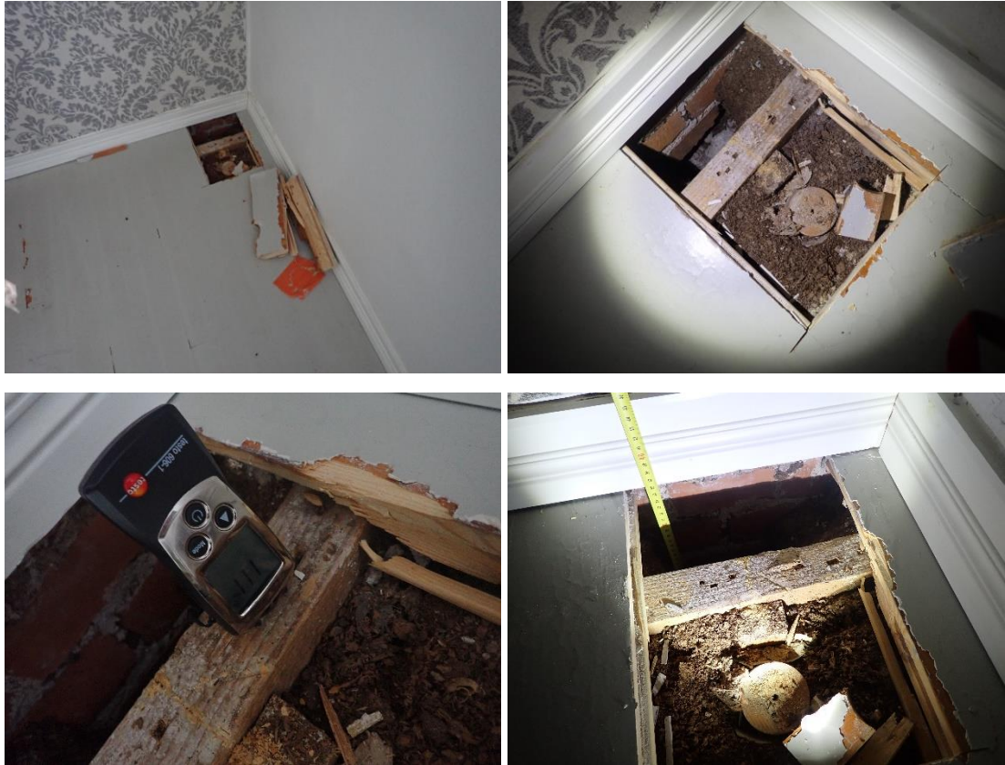
Kuvat 125, 126, 127 ja 128. Rakenneavaus R17 VP asunnon 1 makuuhuone. Rakenneavauksesta otettiin näyte N16 (turve) mikrobialyysiin. Näytteessä esiintyy mikrobikasvustoa.
