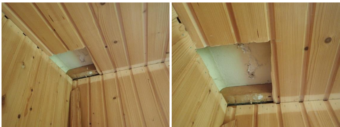
Kuvat 185 ja 186. Rakenneavaus R15 YP. Rakenneavauksesta otettiin näyte N14 (tasoite + maali) mikrobianalyyysiin. Näytteessä esiintyy mikrobikasvustoa.
