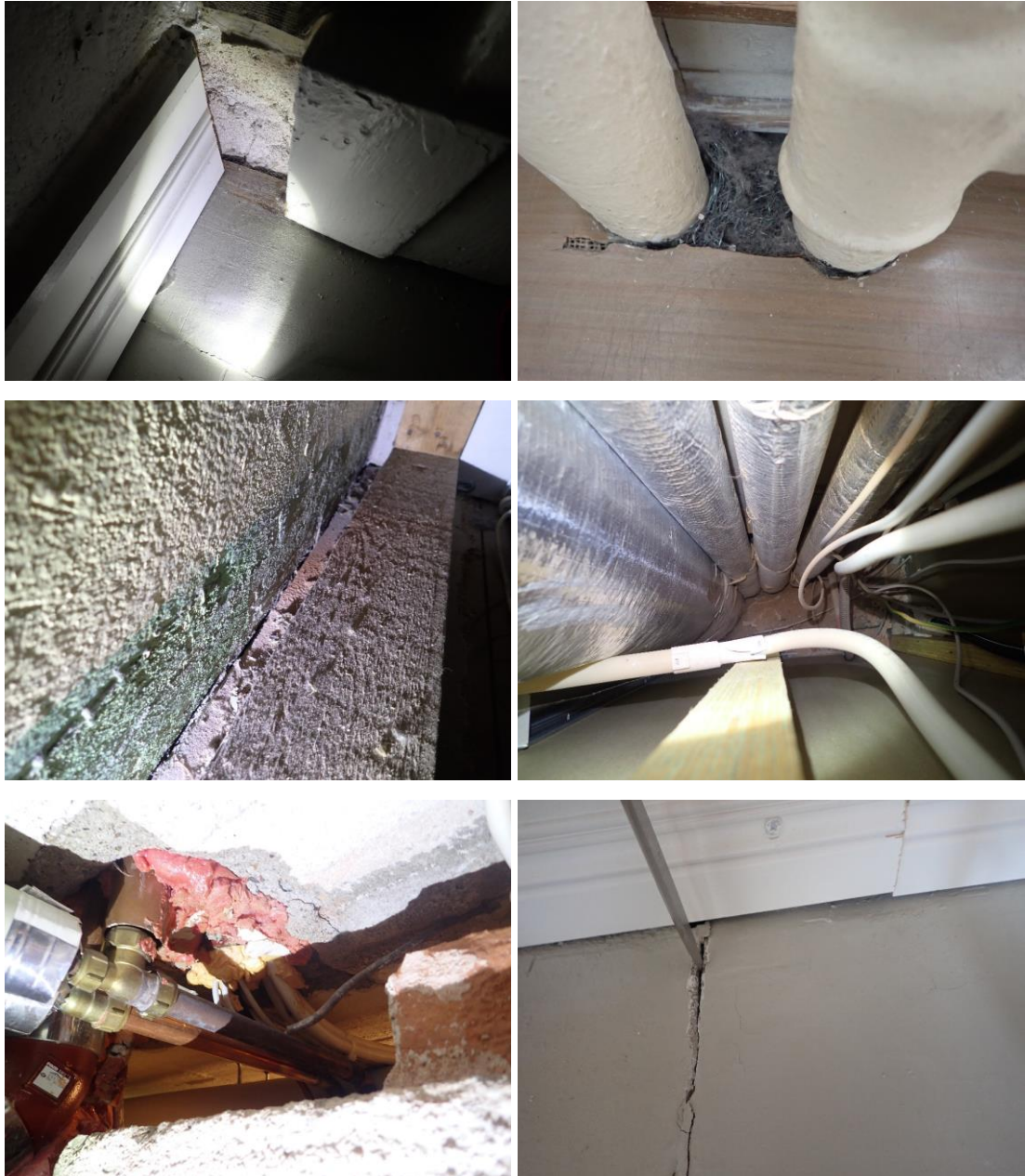
Kuvat 96, 97, 98, 99, 100 ja 101. Välipohjarakenteissa havaittiin ilmavuotokohtia rakenneliittymissä ja läpivienneissä.
