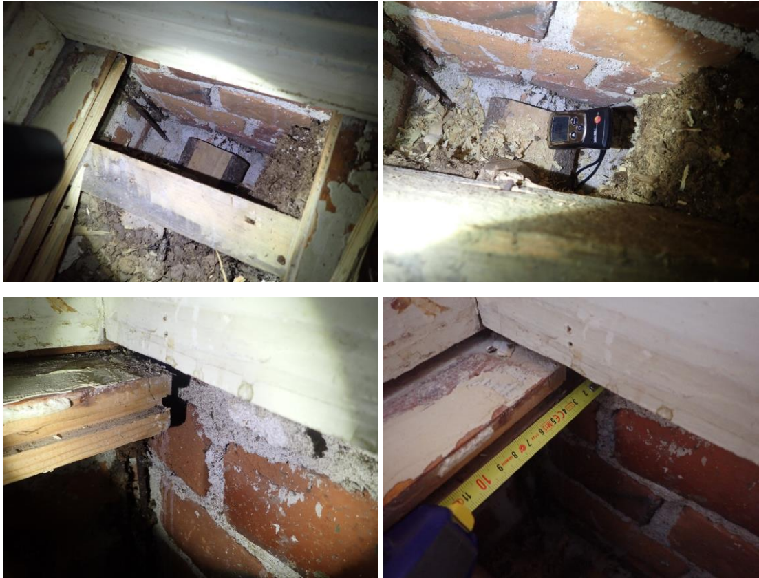
Kuvat 112, 113, 114 ja 115. Rakenneavaus R10 VP asunnon 7 olohuone. Rakenneavauksesta otettiin näyte N9 (turve, kutteri) mikrobialalyysiin. Suoramikroskooppin perusteella näytteessä on sienikasvusto.
