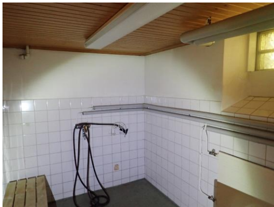
Kuvat 16, 17 ja 18. Pesuhuoneessa ja saunassa on keraaminen laatoitus, talopesulassa on massalattia.
