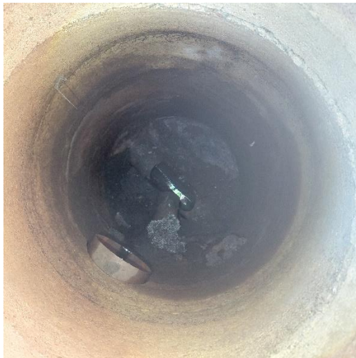
Kuva 11. Kadulla oleva jätevesikaivo johon kohteena olevan rakennuksen jätevedet laskevat.
