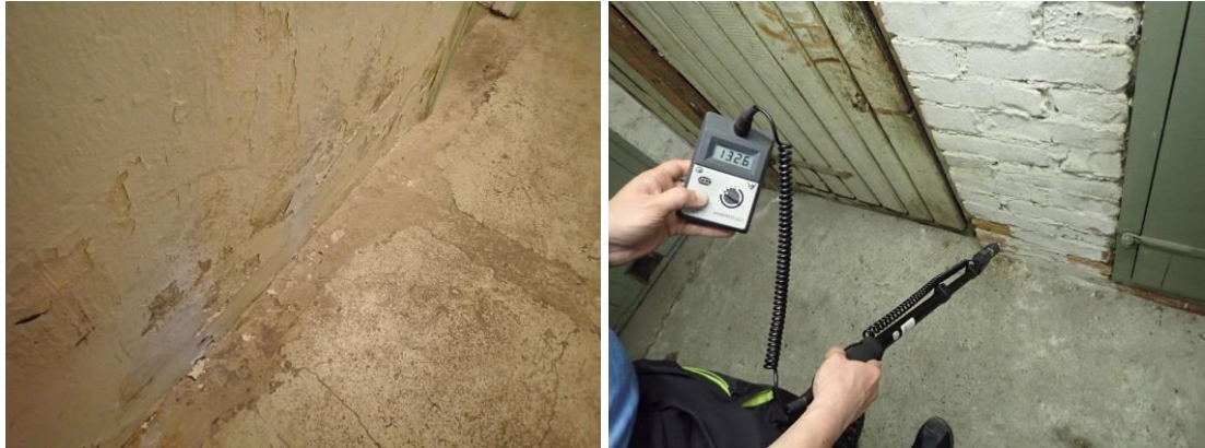
Kuvat 82 ja 83. Kellaritiloissa väliseinäpinnat ovat pääosin huonokuntoisia. Pannoilla on havaittavissa monin paikoin maali- ja tasoitepintojen hilseilyä ja kalkkihärmää.
