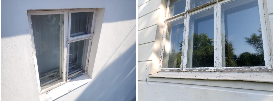
Kuvat 74 ja 75. Ikkunoiden karmien ja ikkunapokien ulkopuolen maalipinnat ovat yleisesti erittäin huonossa kunnossa. Rakenneliittymissä on vesitiiviyspuutteita.
