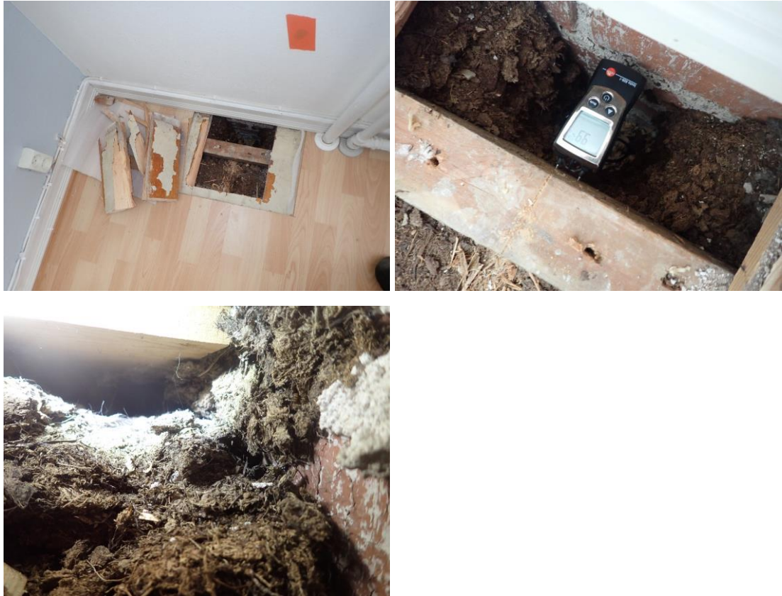
Kuvat 116, 117 ja 118. Rakenneavaus R11 VP asunnon 7 makuuhuone. Rakenneavauksesta otettiin näyte N10 (turve, kutteri) mikrobianalyysiin. Suoramikroskooppin perusteella näytteessä on sienikasvusto.
