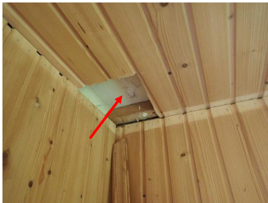
Kuvat 154, 155 ja 156. Asunnon 3 kuistin vesikatteen ja ulkoseinän liittymä ei ole vesitiivis. Se on aiheuttanut alapuolisiin rakenteisiin vaurioita (R15 YP).
