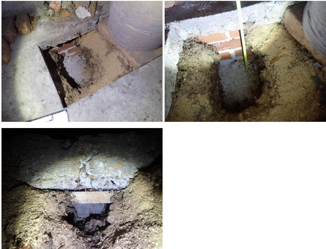
Kuvat 173, 174 ja 175. Rakenneavaus R6 YP. Rakenneavauksesta otettiin näyte N6 (turve) mikrobi-analyysiin. Näytteessä ei esiinny mikrobikasvustoa.
