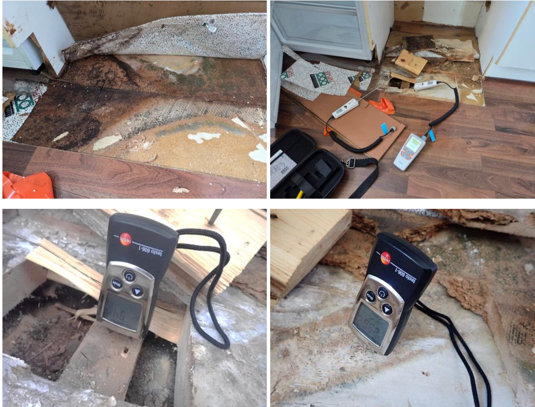
Kuvat 108, 109, 110 ja 111. Rakenneavaus R9 VP asunnon 7 keittiö. Välipohjarakenteen pintaosat ovat pahoin vaurioituneet. Rakenneavauksesta otettiin näyte N8 (turve) mikrobialyysiin. Näytteessä esiintyy mikrobikasvustoa.
