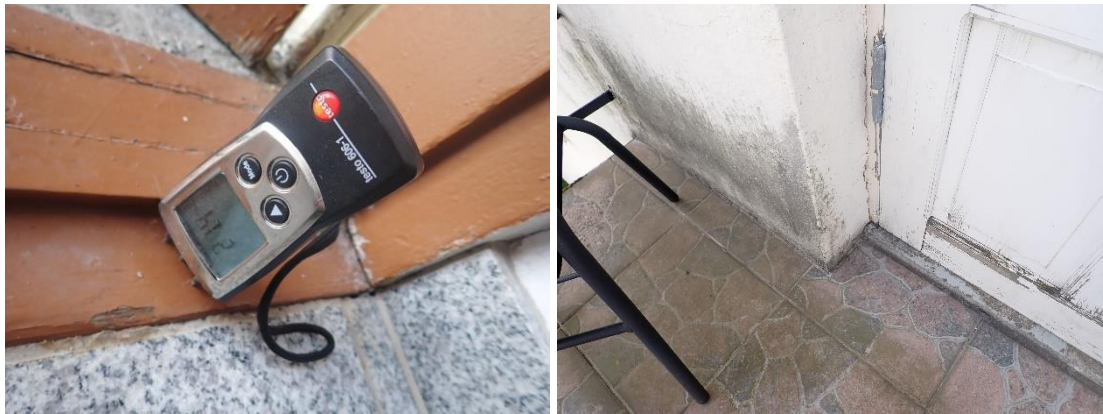
Kuvat 76 ja 77. Porrashuoneen parvekeoven kynnys on kostea. Rakenneliittymissä on vesitiiviyspuutteita.
