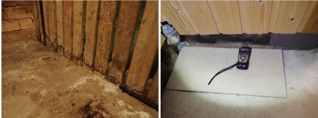
Kuvat 19 ja 20. Huoneistovarastojen puurakenteet ovat alaosistaan monin paikoin lahovaurioituneita. Myös muut puurakenteet, jotka ovat kosketuksissa alapohjaan, ovat kosteita/märkiä.
