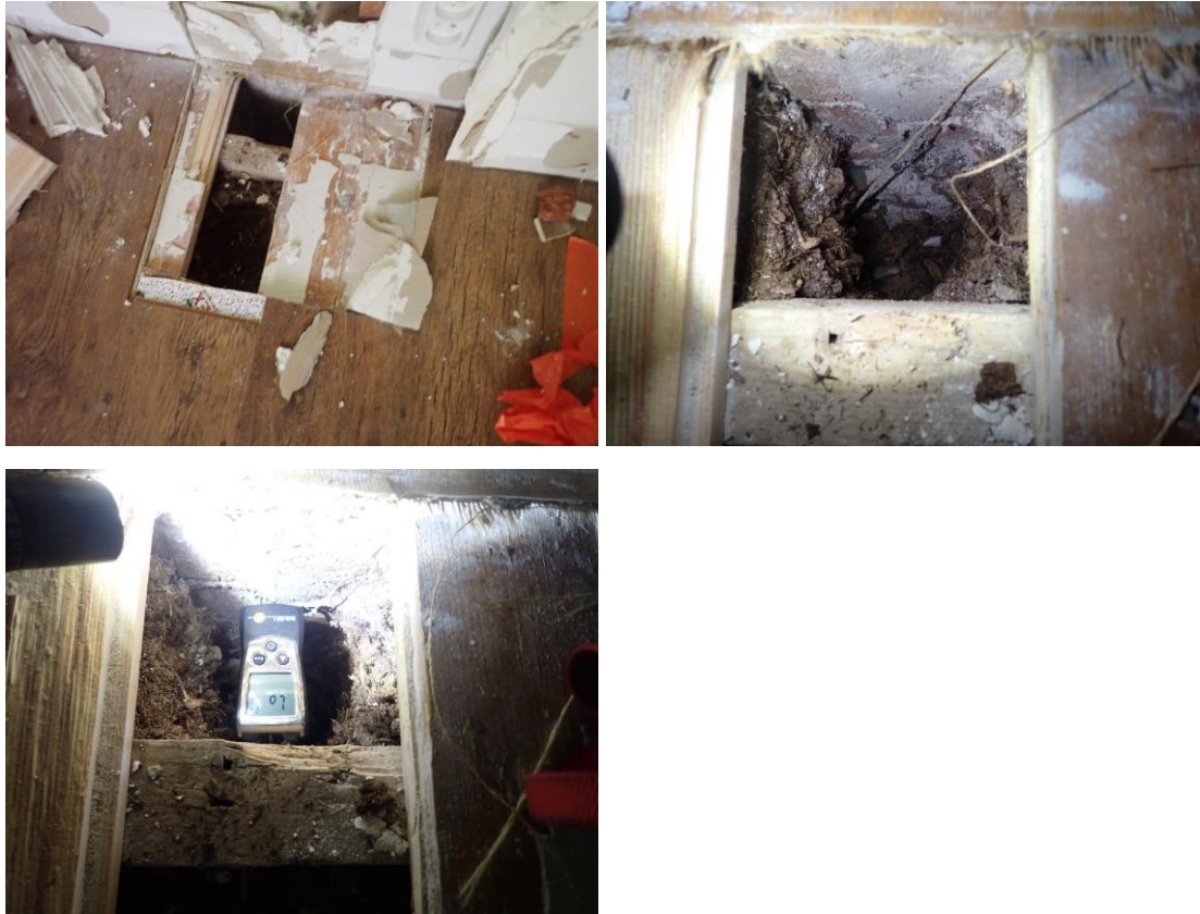
Kuvat 119, 120 ja 121. Rakenneavaus R12 VP asunnon 7 makuuhuone. Rakenneavauksesta otettiin näyte N11 (turve) mikrobianalyysiin. Näytteessä ei esiintynyt mikrobikasvustoa.
