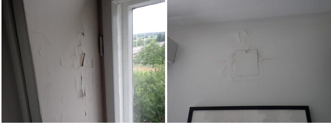
Kuvat 48 ja 49. Ulkoseinillä havaittiin maali- ja rappauspintojen hilseilyä lähinnä ikkunoiden pielissä sekä korvausilmaventtiilien läheisyydessä.
