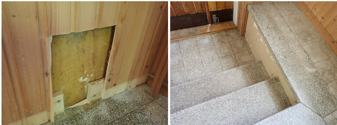
Kuvat 50 ja 51. Asunnossa 3 kuistin ulkoseinät ovat sisäpuolelta paneloituja. Kuistin porraskielissä esiintyy maali- ja rappauspintojen hilseilyä sekä vertailuarvoista poikkeavia pintakosteudenosoittimen lukemia (100–110).
