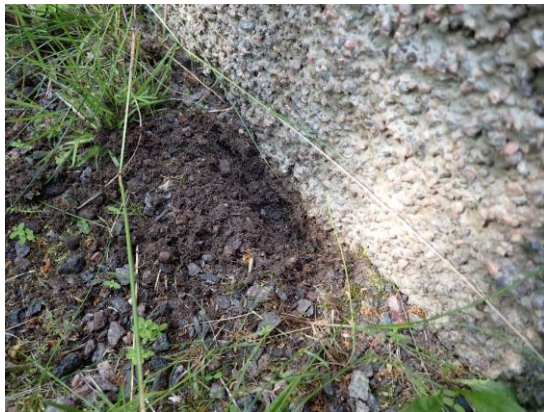
Kuva 8. Rakennuksen vierustalla on hienorakeista hiekkaa, joka on monin paikoin kasvillisuuden peitossa. Maanvastaisessa seinärakenteessa ei havaittu ulkopuolista lämmön- eikä vedeneristystä.
