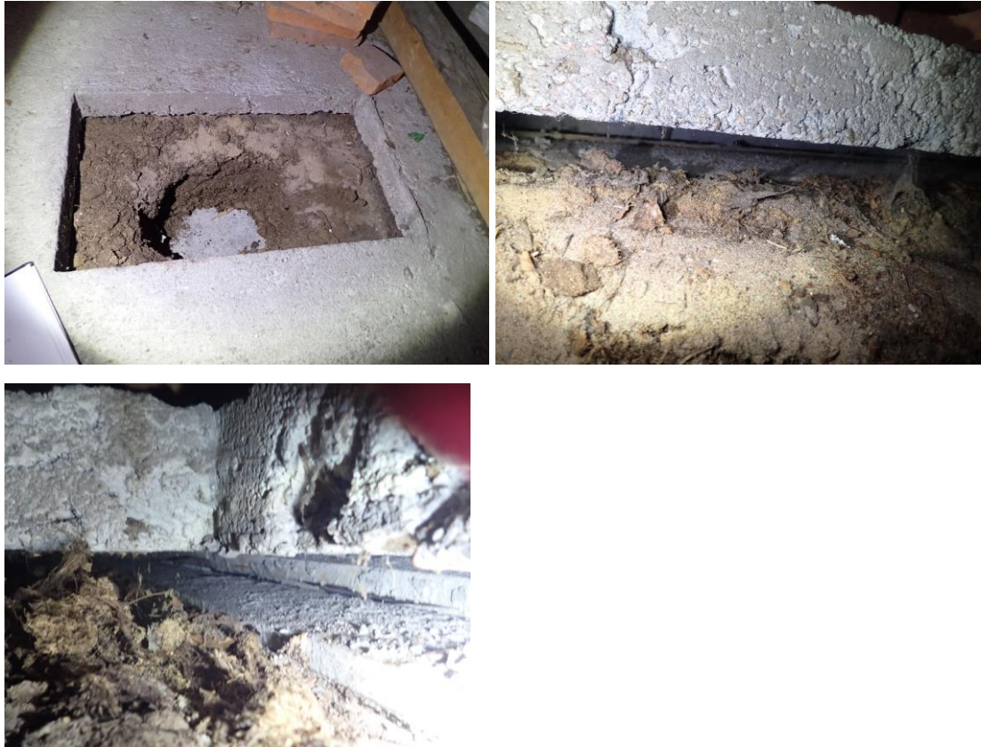
Kuvat 170, 171 ja 172. Rakenneavaus R5 YP. Rakenneavauksesta otettiin näyte N5 (turve) mikrobi-analyysiin. Näytteessä ei esiinny mikrobikasvustoa.
