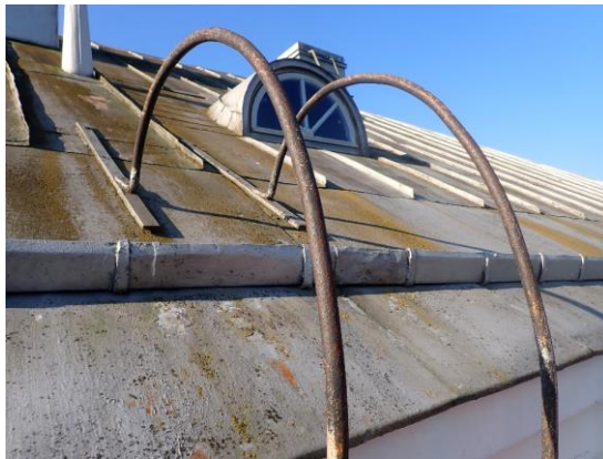
Kuvat 136, 137 ja 138. Yleiskuvia vesikatolta. Rivipeltikatteen maalipinnoite on heikossa kunnossa. Pohjoisen puoleinen lape on erittäin likainen. Vesikatolle on julkisivussa seinätikkaat, mutta lapetikkaita ei ole. Seinätikkaiden yläosan kiinnitys on puutteellinen.
