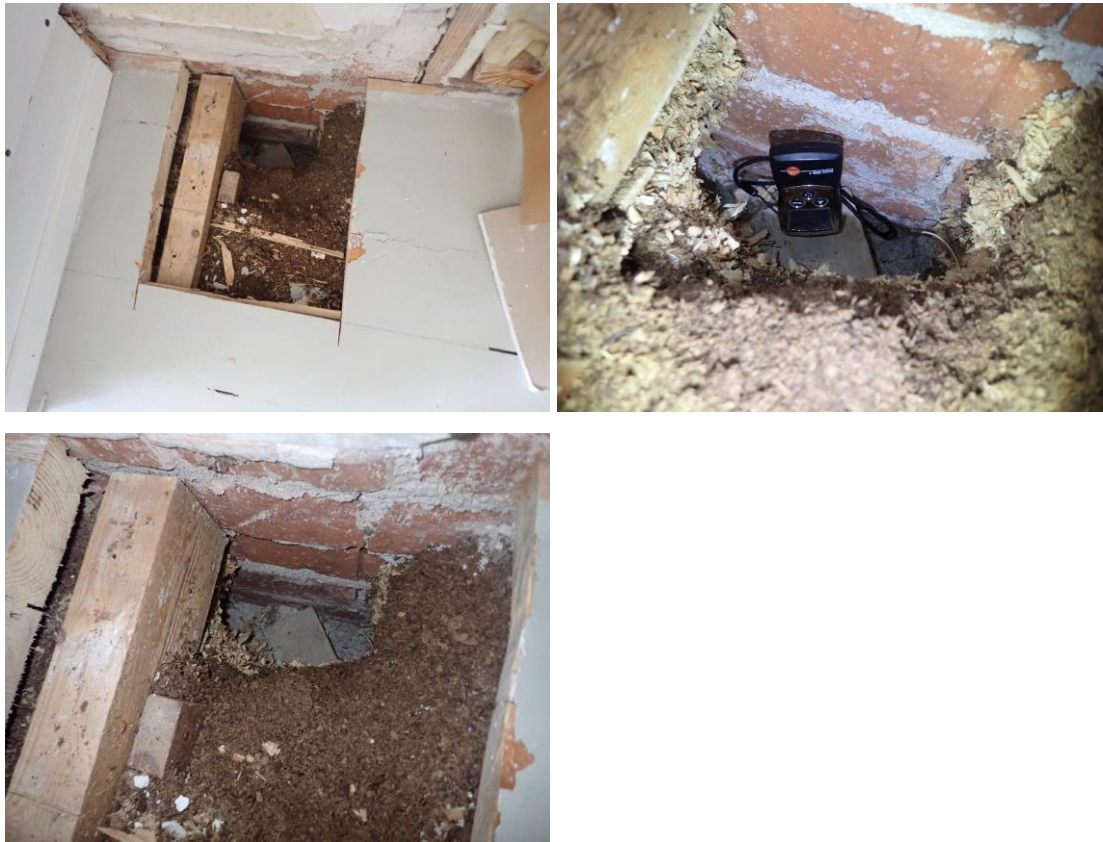
Kuvat 131, 132 ja 133. Rakenneavaus R19 VP asunnon 1 makuuhuone. Rakenneavauksesta otettiin näyte N18 (turve, kutteri) mikrobialalyysiin. Suoramikroskoippinin perusteella näytteessä on sienikasvusto.
