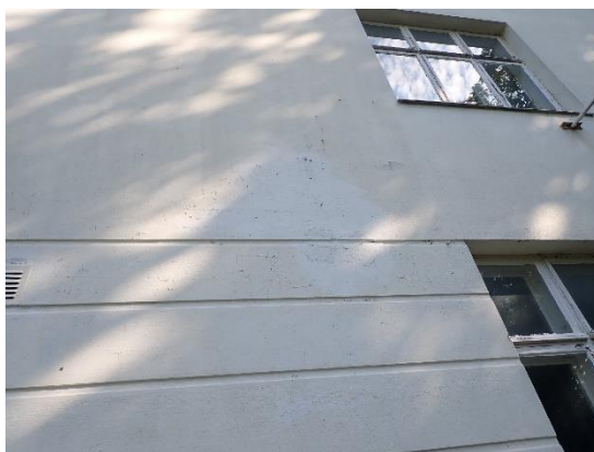
Kuvat 34, 35 ja 36. Julkisivuilla havaittiin monin paikoin verkkomaista halkeilua. Julkisivussa on havaittavissa yksittäisiä paikkakorjattuja alueita.
