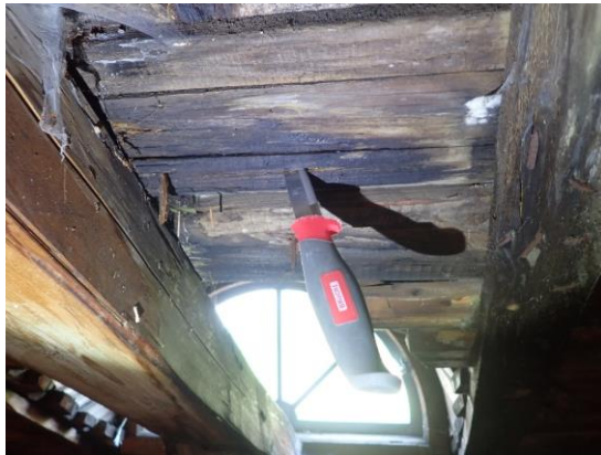
Kuvat 162, 163 ja 164. Pohjoislappeella olevan kattolyhtyikkunan läheisyydessä on laajempi kosteus- ja lahovaurioalue. Tutkimushetkellä puurakenteet olivat kuivia.
