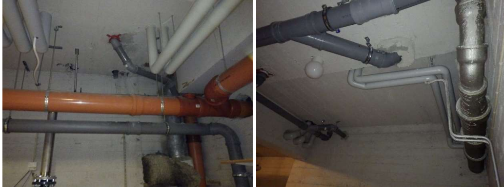
Kuva 25 ja 26. Kellarikerroksessa olevat välipohjan läpiviennit ovat lattiatasolta tarkastellen epätiivittä.
