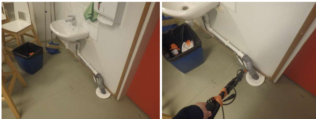
Kuva 31 ja 32. Huoneessa 111 kellarista kulkeutuvaa runsasta ilmapuotoa havaittiin oven vierellä olevan käsienvesualtaan vesi- ja viemäriputkien läpivienneissä (koe MA1).
