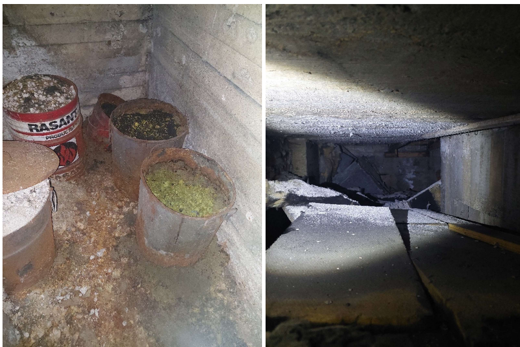
Kuva 19 ja 20. Entisen kattilahuoneen lattialla on ruostuneita sankoja, joissa olevien polttojätteiden päällä on runsasta mikrobikasvustoa. Lämmönjakuhuoneen katon koolaukset ovat osittain romahtaneet.
