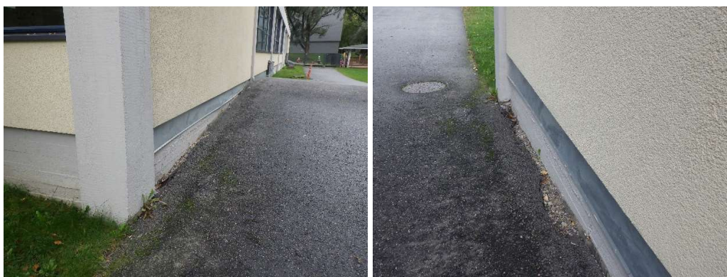
Kuva 4 ja 5. Itäreunalla rakennuksen vierustalla havaittiin merkkejä painumisesta.
