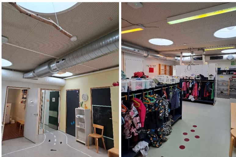
Kuva 12 ja 13. Tuloilmakanavien puhdistusluukut sijaitsevat auloissa 123 ja 132.
