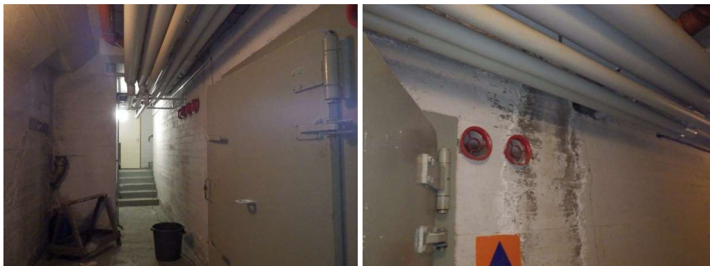
Kuva 17 ja 18. Kellarikäytävällä, väestönsuojan väliseinän yläosassa havaittiin valumajälkiä ja aktiivista vesivuotoa. Väliseinässä havaittiin merkkejä pitkään jatkuneesta vesivuodosta sekä päivän kuluessa vapaata vettä.
