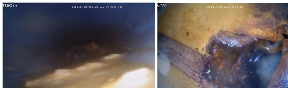
Kuva 36 ja 37. Vasemmassa kuvassa (JVTV1) vaakaosuudella viemäriputken tukkeumaa vaakaosalla. Oikeassa kuvassa (JVTV4) keittiön lattiakaivolinjan viemärissä reikä sukituksen ja valurautaisessa viemärissä.
