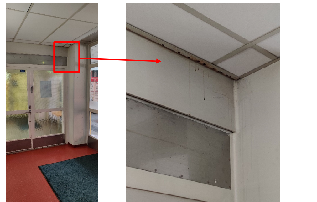
Kuva 21. G- ja F-osan rajalla yläpohjassa on vuotojälki. Vuotojäljen yläpuolelta kerättyssä materiaalinäytteessä esiintyi mikrobikasvustoa (M6).
