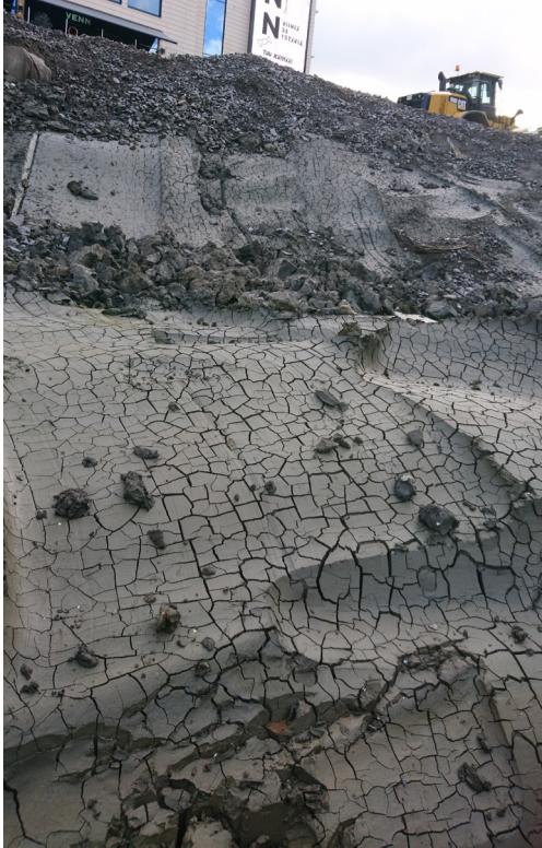
Kuva 1. Kuvassa tyypillinen esimerkki sulfidisavesta. Turun toriparkin kaivettu seinämä kuivuneena ja hapettuneena. Pinnan pH oli laskenut.
