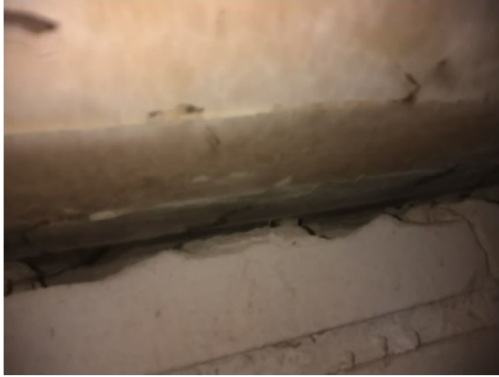
Kuva 5.22. Yläpohjassa ei ole käytännössä räystästuuletusta lainkaan.
