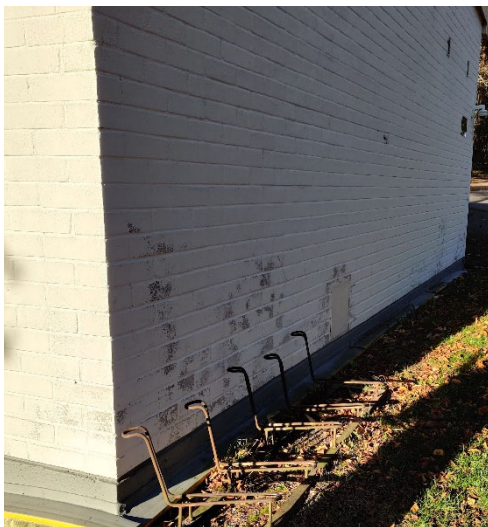
Kuva 5.1. Itäisivulla maali on paikoin hilseilyt.
