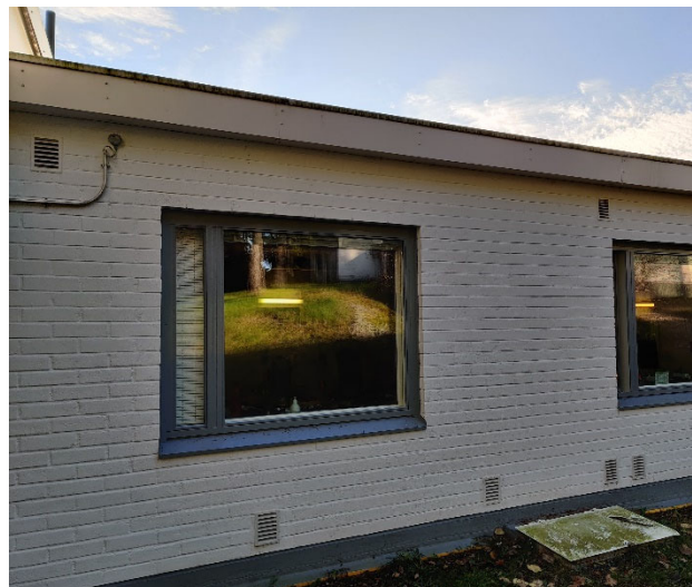
Kuva 5.2. Julkisivussa on runsaasti painovoimaisen ilmanvaihdon korvausilmasäleikköjä. Julkisivusta puuttuu kuitenkin tuuletusraot.
