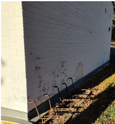
Kuva 3.2. Itäpäädyn maali on paikoin hilseillyt.
