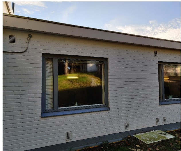
Kuva 3.3. Julkisivussa on runsaasti painovoimaisen ilmanvaihdon korvausilmasäleikköjä. Julkisivusta puuttuu kuitenkin tuuletusraot.
