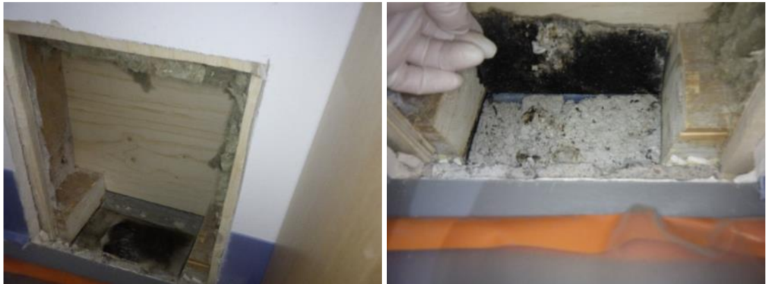
Kuva 117 ja 118. Rakenneavaus R17 salissa 152. Väliseinän alaohjauspuuta ei ole uusittu. Seinän sisällä, toisella puolella olevan pesutilan reunalla lattialiittymässä havaittiin tiivistemassaa. Rungon puuosissa tai rungon alla olevassa alapohjan betonissa ei havaittu viitteitä kohonneesta kosteudesta.
