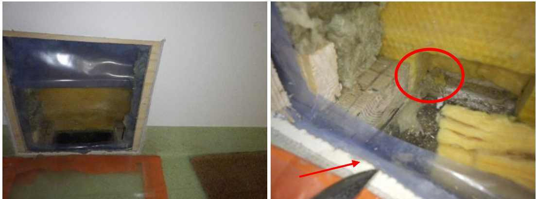
Kuva 91 ja 92. Rakenneavaus R6 tilassa 174. Ulkoseinän eristeitä on uusittu. Tuulensuojalevyn alla havaittiin villakaista (ympyrä), jossa ei todettu mikrobivaurioita. Rakenteen höyrynsulku on epätiivis (nuoli).
