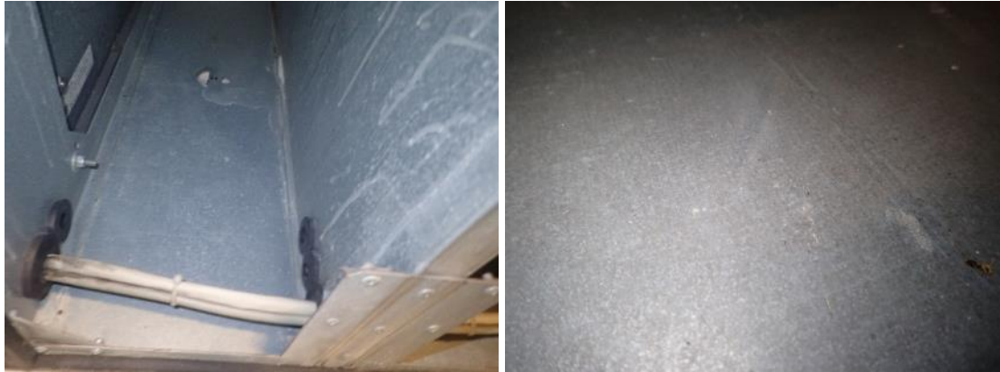
Kuvat 165 ja 166. Kondenssivedet on johdettu vesilukon kanssa viemäriin. Pölykertymä ilmanvaihtokoneen pinnoilla oli pieni.
