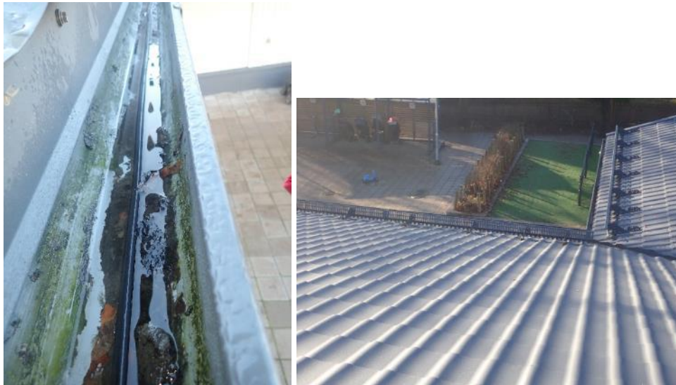
Kuva 133 ja 134. Räystäskouruissa on sulanapitokaapelit. Kouruihin oli kertynyt epäpuhtauksia. Räystäillä oli lumiesteet.
