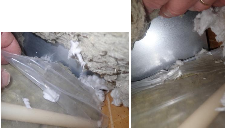
Kuva 143 ja 144. Teippaamattomia ilmanvaihtokanavien höyrynsulkujen läpivientejä.
