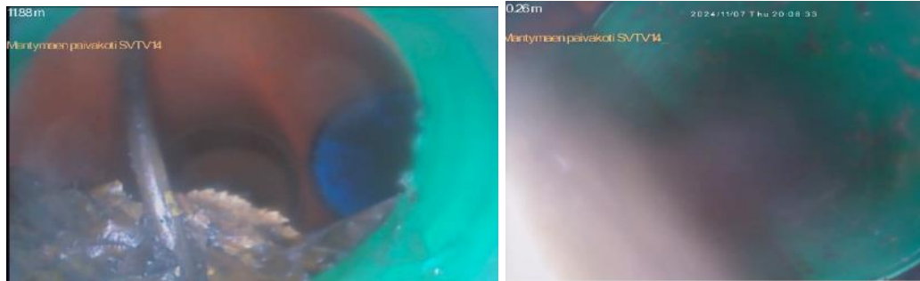
Kuvat 202 ja 203. Vasemmassa kuvassa (SVTV14) sadevesilinjassa lehtiä ja lietettä. Oikeassa kuvassa (SVTV14) sadevesikaivonlähdössä lievää vesitäytettä.
