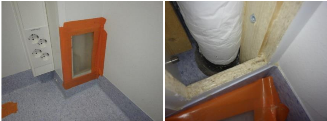
Kuva 127 ja 128. Lastulevykoteloinnin avaus R5 Pupujen osastolla tilassa 169. Kotelon sisällä kulkeva lämpöeristetty vesiputki lävistää alapohjan betonilaatan. Putken takana olevaa ulkoseinän nurkkaliittymää ei päästy tarkastamaan.
