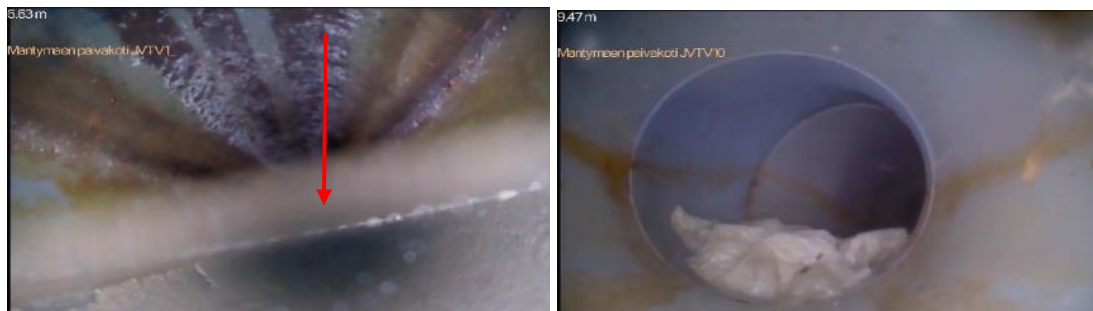
Kuvat 196 ja 197. Vasemmassa kuvassa (JTV1) runkolinjan painauma (vedenpinta osoitettu punaisella nuolella). Oikeassa kuvassa (JTV10) virtausnopeuden heikentymisen vuoksi linjaan jäänyttä paperia.
