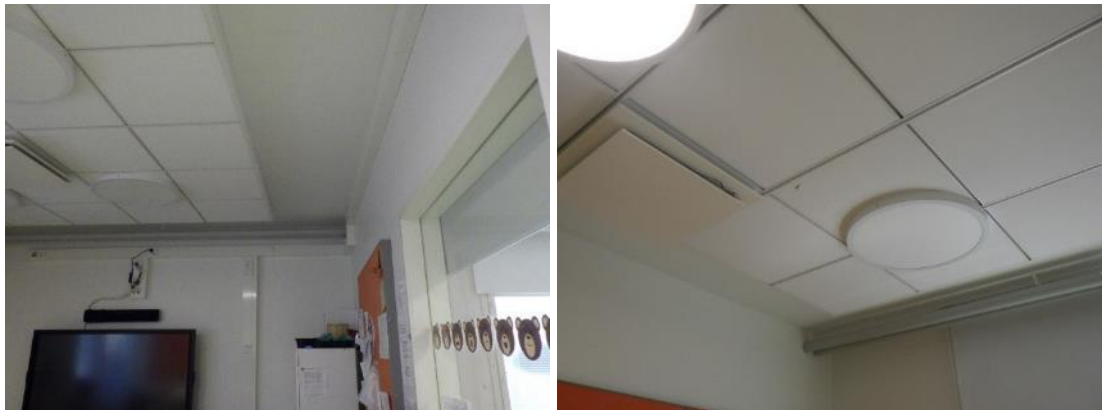
Kuva 145 ja 146. Huoneilojen kipsilevykattoihin on asennettu akustiikkalevytystä. Levyissä ei havaittu avoimia mineraalivillapintoja.
