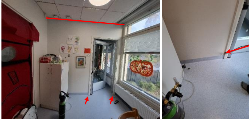
Kuva 77 ja 78. Syöttöpisteen SP3 vuotokohdat Pupujen huoneessa 169 merkittynä kuvaan punaisella viivalla (merkittävä vuoto) ja punaisella nuolella (pistemäinen vuoto).
