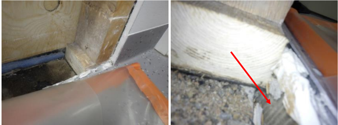
Kuva 114 ja 115. Rakennus R12 käytävällä 155. Väliseinän alaohjauspuuta ei ole uusittu. Seinän sisällä, toisella puolella olevan pesutilan lattialiittymässä havaittiin ruiskutettavaa tiivistemassaa. Väliseinärungon ja lattiavalun välissä havaittiin aaltopahvinen erotuskaista (nuoli), jossa havaittiin mahdollista mikrobikasvua.
