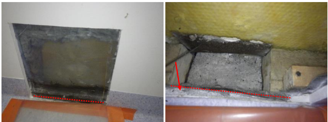
Kuva 95 ja 96. Rakenneavaus R8 tilassa 169. Ulkoseinän alaojhauspuun yläpinta on lattiatasolla ja rungon ja lattiavalun välissä havaittiin styroxia oleva valukaista (nuoli). Rakenteen höyrynsulku
