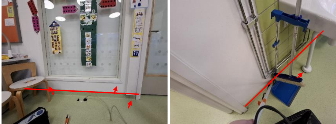
Kuvat 43 ja 44. Syöttöpisteen SP3 vuotokohdat merkittynä kuvaan punaisella viivalla (merkittävä vuoto) ja punaisella nuolella (pistemäinen vuoto).
