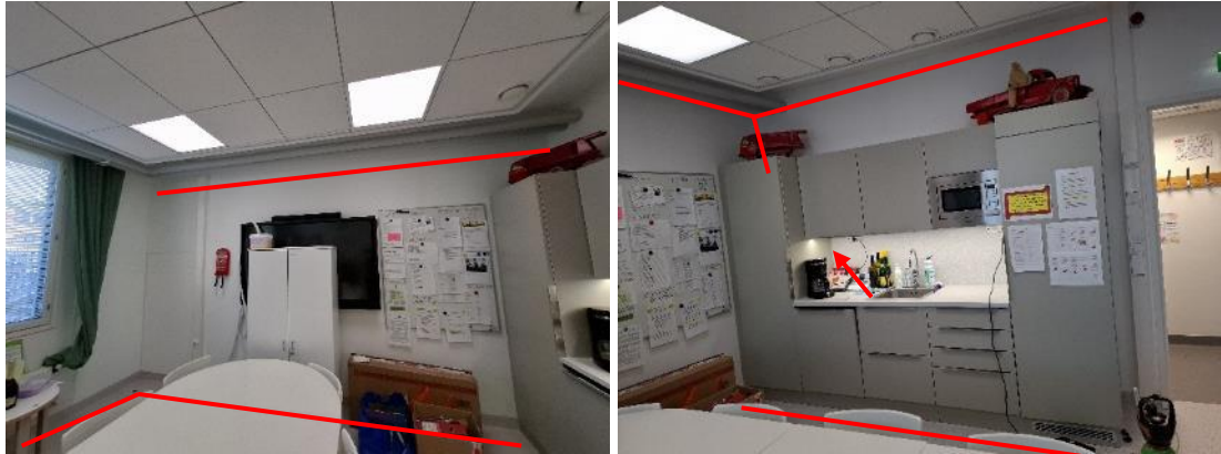
Kuvat 53 ja 54. Syöttöpisteen SP3 vuotokohdat henkilökunnan taukotiassa 128 merkittynä kuvaan punaisella viivalla (merkittävä vuoto) ja punaisella nuolella (pistemäinen vuoto).
