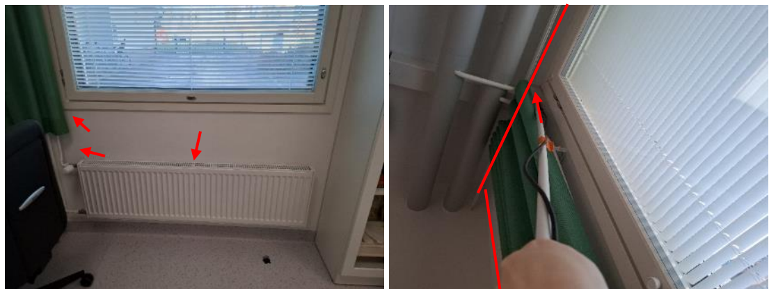
Kuvat 47 ja 48. Syöttöpisteen 1 vuotokohdat merkittynä kuvaan punaisella viivalla (merkittävä vuoto) ja punaisella nuolella (pistemäinen vuoto).
