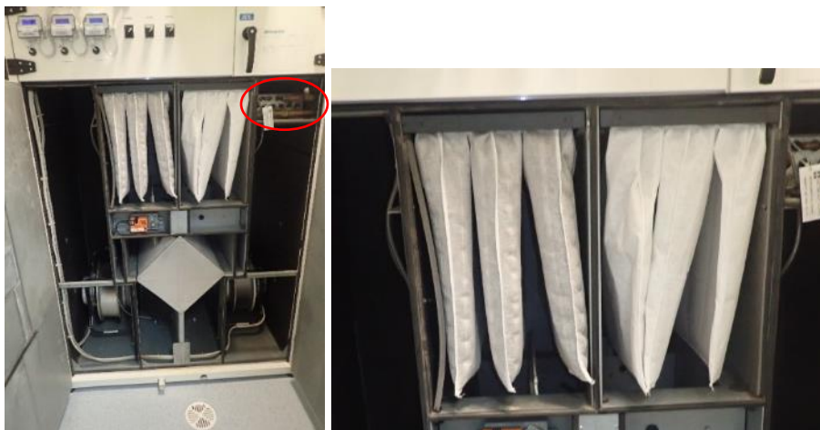
Kuvat 163 ja 164. Tuloilmassa on vesikiertoinen lämmityspatteri (ympyröity). Suodattimet ovat hienosuodattimia ja ne asettuvat tiiviisti kehyksiinsä.
