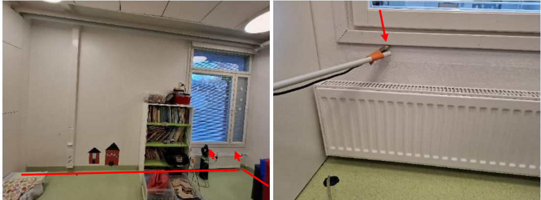
Kuvat 30 ja 31. Syöttöpisteen SP2 vuotokohdat Mansikoiden pienryhmähuoneessa 171 merkittynä kuvaan punaisella viivalla (merkittävä vuoto) ja punaisella nuolella (pistemäinen vuoto).
