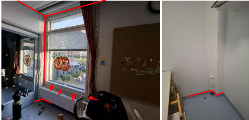
Kuva 73 ja 74. Syöttöpisteen SP1 vuotokohdat Pupujen huoneessa 169 merkittynä kuvaan punaisella viivalla (merkittävä vuoto) ja punaisella nuolella (pistemäinen vuoto).
