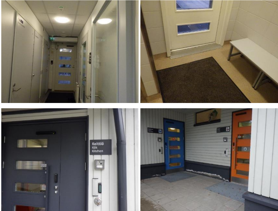
Kuvat 103, 104, 105 ja 106. Rakennuksessa puisten, lasiaukollisten ulko-ovien yhteydessä ei havaittu puutteita.
