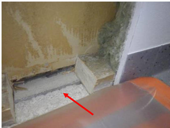
Kuva 116. Rakennus R13 käytävällä 110. Väliseinän alaohjauspuuta ei ole uusittu. Seinän alla kulkee valusauma (nuoli), jonka kautta havaittiin tapahtuvan ilmanliikettä alapohjasta seinän eristestilan suuntaan.
