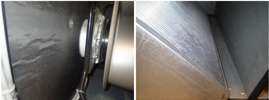
Kuvat 161 ja 162. Puhaltimet ovat suoravetopuhaltimia ja lämmöntalteenotto on toteutettu LTO-kuutiolla.
