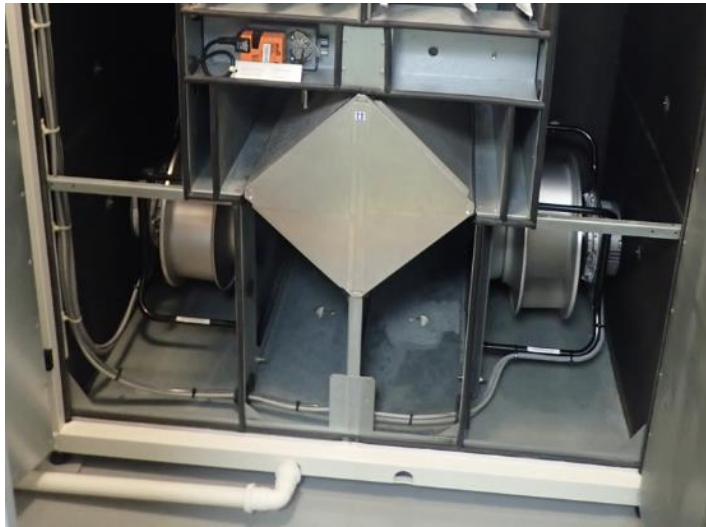
Kuva 167. Puhaltimet ovat suoravetopuhaltimia ja lämmöntalteenotto on toteutettu LTO-kuutiolla. Kondenssivedet on viemäroity.
