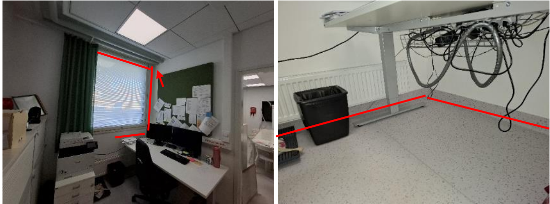
Kuvat 49 ja 50. Syöttöpisteen SP1 vuotokohdat toimistohuoneessa 129 merkittynä kuvaan punaisella viivalla (merkittävä vuoto) ja punaisella nuolella (pistemäinen vuoto).
