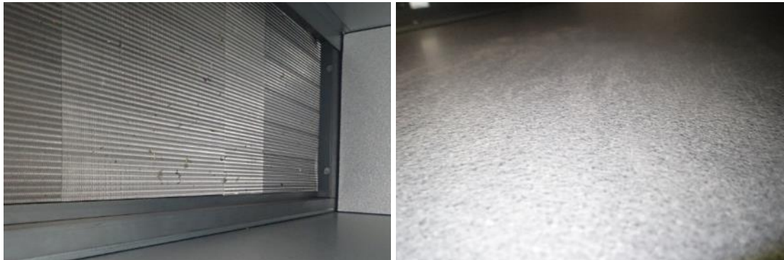
Kuvat 179 ja 180. Tuloilma lämmitetään vesikiertoisella lämmityspatterilla. Pölykertymä pinnoilla oli pieni.
