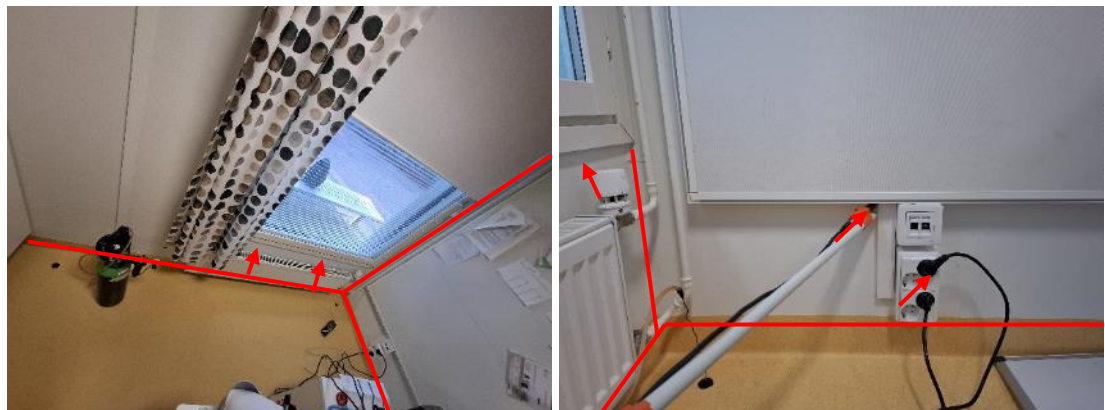
Kuvat 61 ja 62. Syöttöpisteen SP1 vuotokohdat perhosten pienryhmähuoneessa 123 merkittynä kuvan punaisella viivalla (merkittävä vuoto) ja punaisella nuolella (pistemäinen vuoto).
