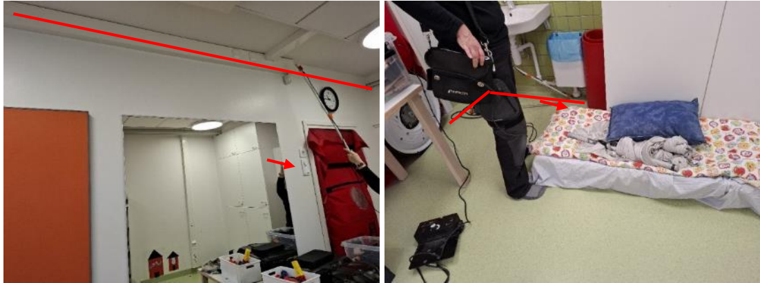
Kuvat 34 ja 35. Syöttöpisteen SP4 vuotokohdat Mansikoiden pienryhmähuoneessa 171 merkittynä kuvaan punaisella viivalla (merkittävä vuoto) ja punaisella nuolella (pistemäinen vuoto).
