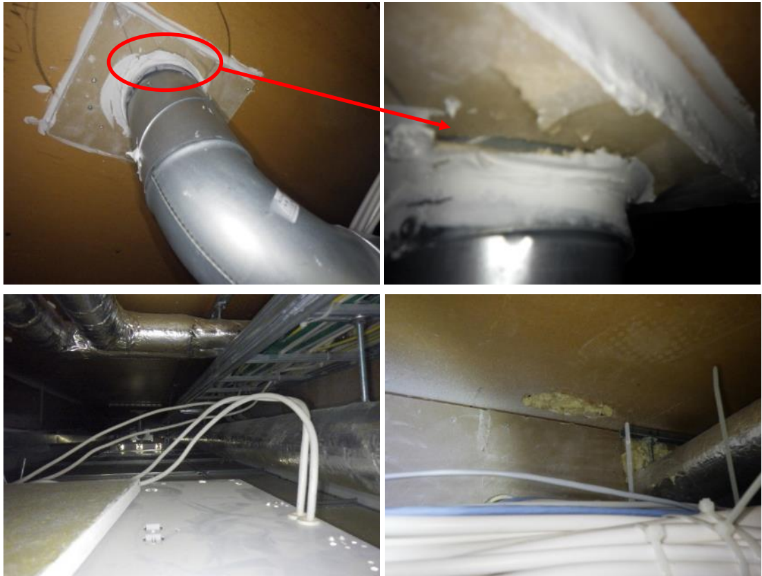
Kuva 153 ja 154. Käytävän 149 alakattotilassa havaittiin epätiitä yläpohjaläpivientejä, runsasta rakennusmateriaaliperäistä pölyä sekä mineraalivillalla tilkittyjä läpivientejä. Alakattotilaan virtaa ilmaa yläpohjan suunnasta.
