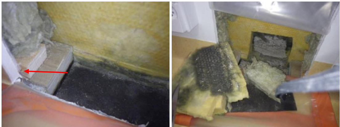
Kuva 97 ja 98. Rakenneavaus R9 tilassa 123. Ulkoseinän alaohjauspuun yläpinta on lattiatasolla. Rakenteen höyrynsulku katkeaa ennen lattiatasoa (nuoli). Valesokkelin sisäpintaan kiinni asennetun tuulensuojalevytyksen sokkelinpuoleisessa pinnassa havaittiin laajaa tummentumaa.
