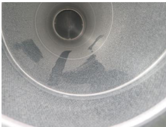
Kuva 195. Leppäkerttujen pesuhuoneen 108 poistoilmakanavistoon oli kertynyt jonkin verran pölyä.
