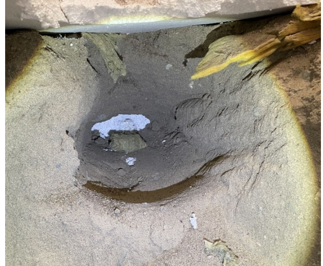
Kuva 5. Paikoin ulkoseinälinjalla oli eps-eristeen alla kahta erityyppistä mineraalivillaa. Kuvan keskellä näkyy sokkelin sisäpuolen eps-eriste. Mineraalivillasta otettiin materiaalinäyte M-1 , jossa ei todettu mikrobivauriota.
