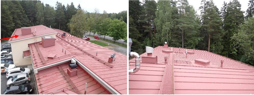
Kuvat 295 ja 296. B-osan kattojen yleisilme siisti. Kuvassa 295 nuolella merkityllä katolla on muita kattoja enemmän pinnon vaurioita.
