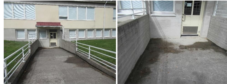
Kuvat 16 ja 17. Kulkuluiskaa pitkin kulkeva sadevesi kastelee luiskan tukimuurien betonipintoja ja ohjautuu paikallisesti ulkoseinän alaosaan. Oven edessä oleva sadevesikaivo on pieni ja tukkiutuu usein.
