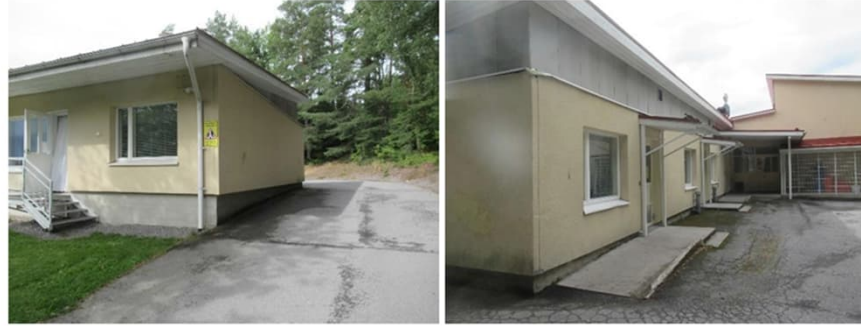
Kuvat 10 ja 11. Itäpäädyssä huoltotien ja -pihan kohdalla rakennuksen vierusta on asfaltoitu. Asfalttipinnoilla ja sokkeleissa, sekä osittain myös rapattujen julkisivujen alaissa havaittiin kosteuden aiheuttamaa tummentumaa sekä levä- ja sammalkasvua.
