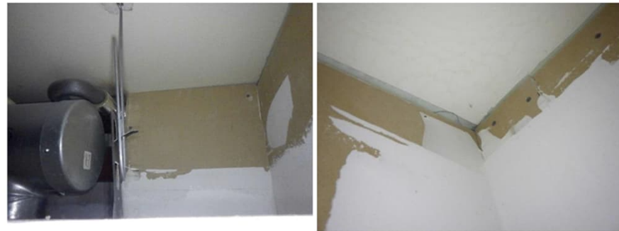
Kuvat 313 ja 314. Alakattoavaukset AK10 ja AK9 luokassa 210. Ulkoseinän lisäeristekerrosta ei ole tiivistetty yläpohjaan ja liittymässä olevasta raosta tapahtuu ilmavirtauksia rakenteen ja alakaton välillä.
