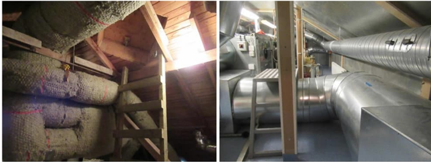
Kuvat 363 ja 364. Yleiskuvat ilmanvaihtokanavista ullakkotilasta ja ilmanvaihtokonehuoneesta. Lähötietojen ja silmämääräisten havaintojen perusteella kanavat ovat pyöreää kierresauma kanavaa. Ullakkotilassa kanavat ovat paloeristetty.
