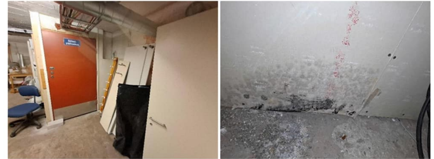
Kuvat 266 ja 267. A-osan kellarin sähköpääkeskuksen seinä on puurunkoinen. Keskuksen sisällä kipsilevytyksen alareunassa havaittiin mikrobikasvun aiheuttama vaurio.
