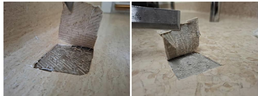
Kuva 76 ja 77. Porrashuoneen 019 viiltomittauksessa V5 suhteellinen kosteus oli korkea lattiapäällysteen alla. Viillosta havaittiin vahvaa mikrobiperäistä hajua. Tekstiilityöluokan 201 ilmanvastaisen alapohjan viiltokosteusmittauksessa V6 suhteellinen kosteus oli koholla lattiapäällysteen alla. Viillosta havaittiin kemiallista hajua.
