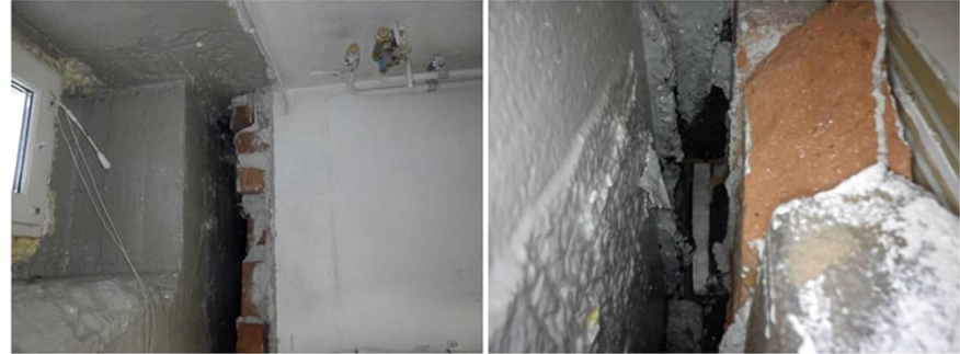
Kuvat 174 ja 175. Saneerauksen yhteydessä kellarin keveät tiiliväliseinät on avattu ulkoseinien vierustoilta. Väliseinäylytysten kohdalla havaittiin jäämiä ulkoseinien sisäpinnoilla olleesta PAH-yhdisteipitoisesta vedeneristeestä. Tiloissa havaittiin PAH-yhdisteisiin viittaavaa hajua.
