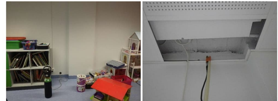
Kuvat 274 ja 275. Väliseinän merkkiainekoe MA24 huonetilassa 138. Väliseinän alareunaan syötetty kaasu kulkee huoneeseen alakaton takana olevasta yläpohjaliittymästä. Vuoto on erittäin runsasta.
