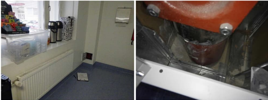
Kuvat 134 ja 135. Opettajanhuoneen 101 keittiötilassa 104 olevasta levykoteloinnista virtaa ilmaa tilojen normaalissa ilmanvaihdossa kellarikerroksen suunnasta huonetiloihin.
