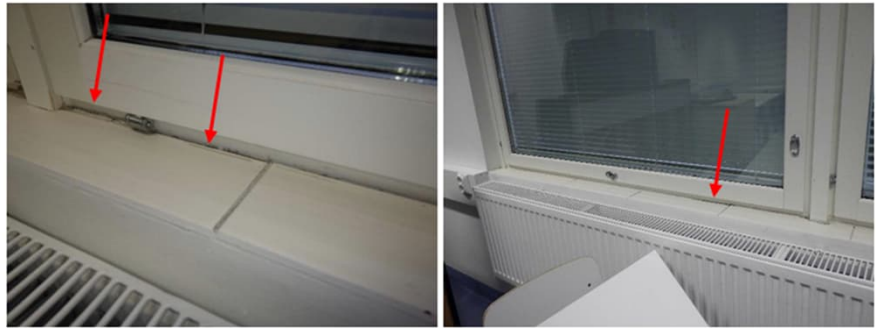
Kuvat 188 ja 189. B-osan luokkatiloissa ikkunoiden liittymät ovat epätiivitä. Liittymistä havaittiin merkisavutarkastelussa ilmanliikettä huonetilan ja rakenteen välillä (nuolet).
