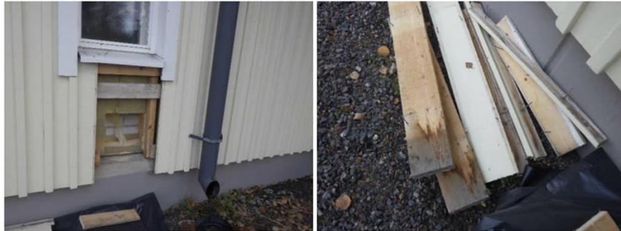
Kuvat 66 ja 67. Rakenneavaus R4 käytävän 103 kohdalla. Ulkoverhouslautojen taustoissa sekä vaakoolauksessa havaittiin runsaasti kosteusjälkiä sekä pehmentymää.
