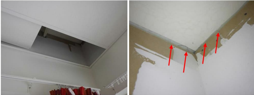
Kuvat 182 ja 183. Alakattoavaus AK9 luokassa 210. Ulkoseinien lisäeristekerros ei ole tiivis. Höyrynsulkumuovin leikattu reuna (nuolet) kiertyy esiin levytyksen ja kiviaineisen yläpohjan välissä olevasta raosta.
