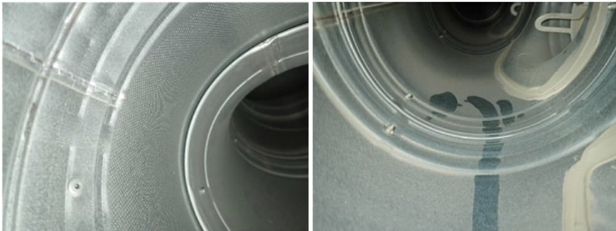
Kuvat 367 ja 368. Yleiskuvat poistoilmakanavista. Tarkasteluiden perusteella yleisten tilojen ja opetustilojen poistoilmakanavat olivat lähes puhtaat (vasen kuva). Puutyötilan poistoilmakanavassa havaittiin kertynyttä puupölyä (oikea kuva).
