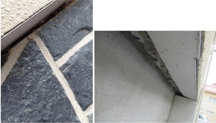
Kuvat 168 ja 169. Julkisivun lämpörappauksen alareunaan asennettu umpinainen metallilista estää eristetilaan kulkeutuvan kosteuden kuivumisen ja lisää ulkoseinien kosteusrasitetta.
