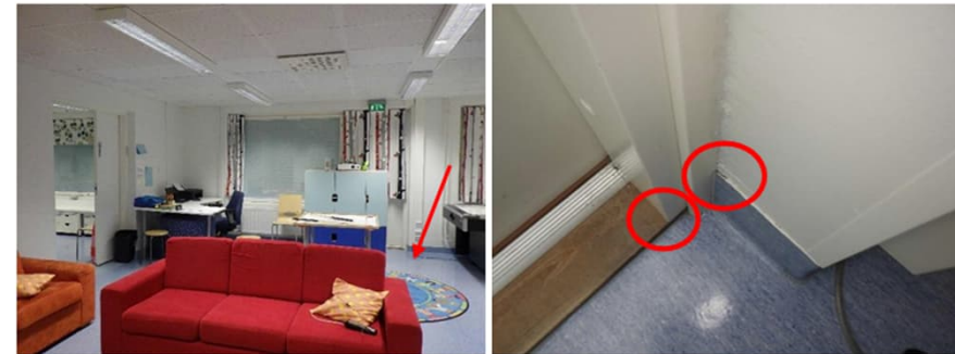
Kuvat 150 ja 151. Merkkiainekoe MA25 iltapäiväkerhon huonetilassa 138. Välipohjan eristetilaan syötettyä merkkiainetta kulkeutuu huoneeseen ovikynnyksen reunoilta sekä ulkoseinäliittymästä, mattonnoston reunalta. Syöttöpiste on merkattu kuvaan punaisella nuolella ja kynnyksalueen merkittävät epätiivyyshkohdat punaisilla ympyröillä.
