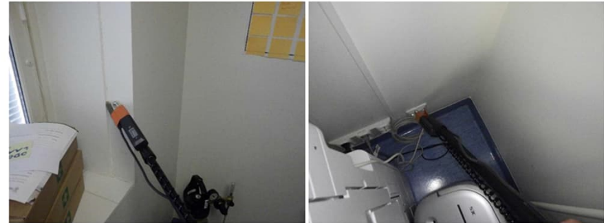
Kuvat 141 ja 142. Välipohjan merkkiainekoe MA3 opettajanhuoneessa 101. Merkkiaine kulkeutuu välipohjan eristetilasta ulkoseinien lisäeristekerrokseen ja virtaa huonetilaan ikkunapenkin reunalta, levy- ja kivirakenteisten seinäosuuksien välissä olevista halkeamista sekä terassinvastaisen ulkoseinän alaosassa olevien kytkimien reunoilta.
