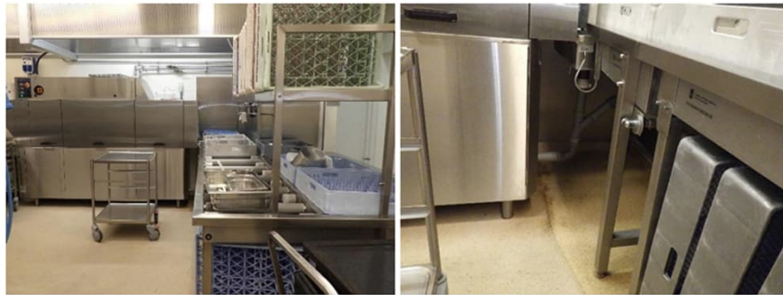
Kuvat 61 ja 62. Tiskilinjaston kohdalla vesi kerääntyy heikkojen lattiakaatojen takia lattialle ja linjaston alle syntyy säännöllisesti tummaa mikrobikasvua.
