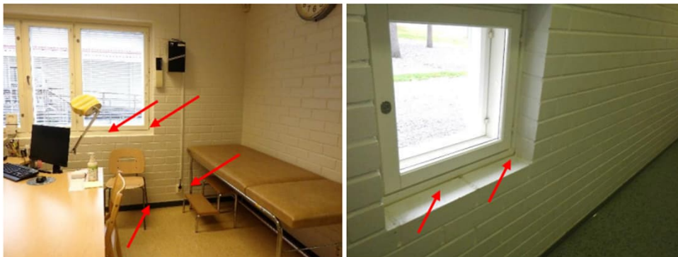
Kuvat 56 ja 57. Merkkisavutarkastelussa tiiliverhottujen ulkoseinien liittymissä ja seinään asennettujen pistorasioitten reunoilla havaittiin ilmavirtausta rakenteesta huonetilojen suuntaan.
