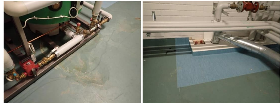
Kuvat 75 ja 76. Vesisäiliön alle vuotanut hiukan vettä. Ympäristössä ei havaittu pintakosteuskartoituksessa poikkeavia lukemia. Välipohjan läpivientien kohdalla mattoa uusittu osittain.
