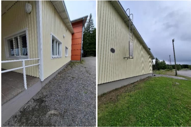
Kuvat 5 ja 6. Rakennuksen vierustat ovat pääosin karkearakeista salaojasoraa. Rakennuksen länsireunalla vierusta on multavaa nurmialuetta. Nurmialueen ja sokkelin välissä havaittiin painunut, multava alue, johon pintavedet pääsevät kerääntymään.
