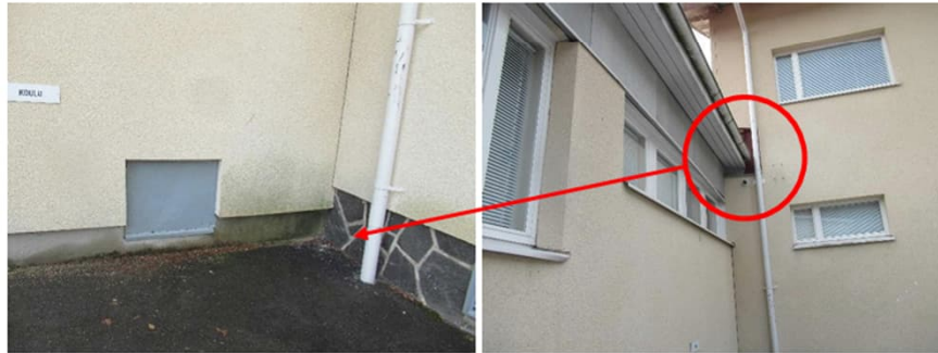
Kuvat 26 ja 27. A- ja B-osan liittymässä sadevesi valuu B-osan kattotasolla olevasta sadevesikourusta ulkoseinälle ja kerääntyy maanpinnalle, josta sen poistuminen on heikkoa. Kulmauksen alueella sokkelissa ja julkisivurappauksen alaosassa havaittiin kosteuden aiheuttamia tummentumia ja leväkasvua.
