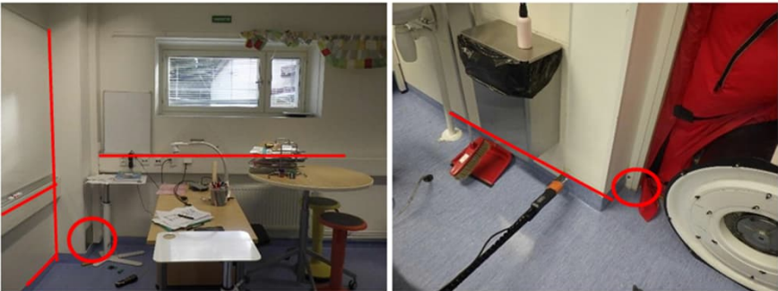
Kuvat 144 ja 145. Merkkiainekokeet MA16 ja MA18 luokassa 109. Kellaritilaan syötettyä merkkiainetta kulkeutuu huoneeseen nurkassa olevasta levykoteloinnin reunoilta ja sisältä sekä ja ulko- ja väliseinillä olevista sähköliustoista. Eristetilaan syötetty merkkiaine virtaa huonetilaan lattialiittymistä, matonkäänteiden reunoilta sekä ovikynnyksen reunoilta.
