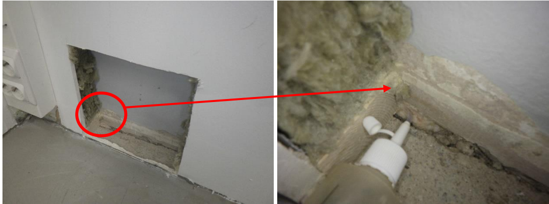
Kuvat 224 ja 225. Ulkoseinän rakenneavaus R3 luokassa 108. Puurungon takana havaittiin ohut mineraalivillalakaista (nuoli). Kiviaineisen ulkoseinän ja lattian liittymässä olevasta raosta havaittiin tapahtuvan ilmavirtausta eristetilasta alapohjan suuntaan.
