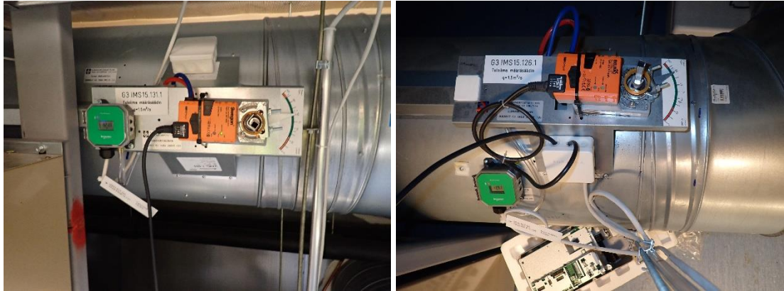
Kuvat 373 ja 374. Yleiskuvat kanaviston ilmamääräsäätimistä. Säätimet ovat nippusiteillä kiinnitetty asennuslevyyn. Arvion perusteella alkuperäiset toimilaitteet on korvattu jälkiasenteisilla laitteilla.
