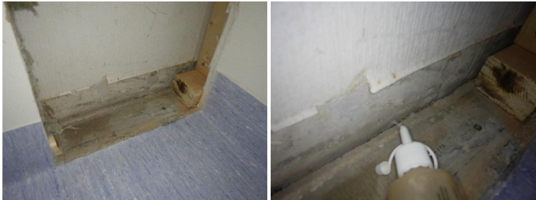
Kuvat 234 ja 235. Ulkoseinän rakenneavaus R21 luokkatilassa 210. Lisäeristeen takana olevan kiviseinän sisäpinnalla havaittiin vanhaa paperitapettia. Lattian ja kiviaineisen seinän välissä olevasta raosta virtaa ilmaa huoneesta välipohjan ontelon suuntaan tilojen ilmanvaihdon normaaliteholla.
