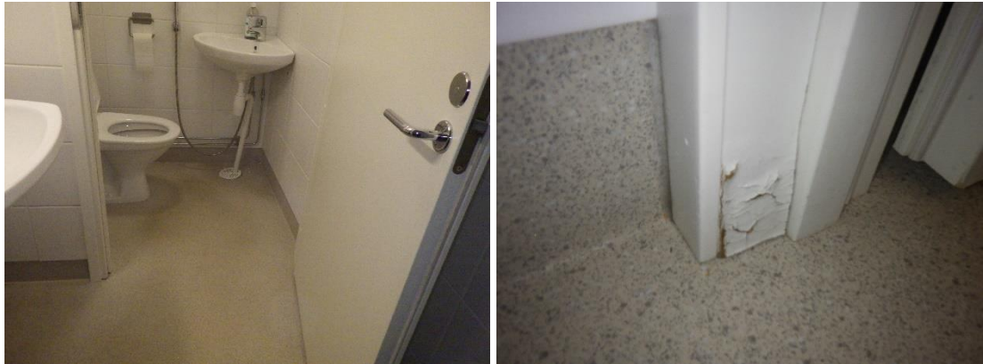
Kuvat 113 ja 114. Opettajanhuoneen wc-tiloissa 102 ja 103 ovipieliin listoissa havaittiin kosteuden aiheuttamia materiaali muutoksia.
