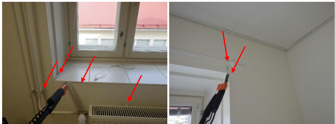
Kuvat 147 ja 148. Merkkiainekoe MA10 luokassa 201. Välipohjan eristetilaan syötettyä merkkiainetta kulkeutuu huoneeseen ikkunapenkin reunalla olevasta halkeamasta, ulkoseinällä olevista kannakointikohdista, ikkuna-alueen levy- ja kivirakenteisen osuuden rajakohdista sekä levyrakenteen nurkka-alueilta.
