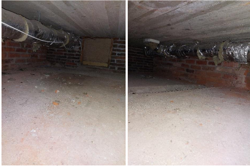
Kuvat 66 ja 67. A- ja B-osien välissä wc-tilojen alla olevassa ryömintätilassa ei havaittu orgaanista ainesta. Tilassa kulkevien putkien suojakuoret ovat rikki.
