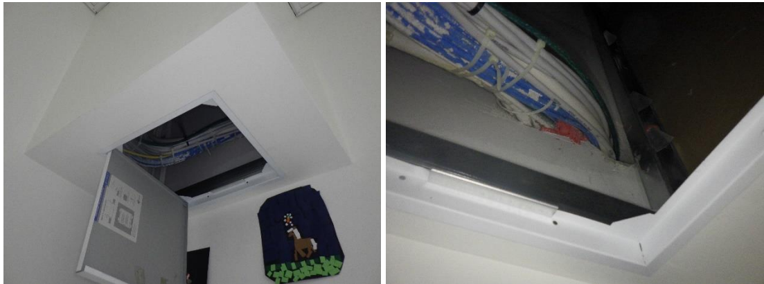
Kuvat 268 ja 269. Levykotelon avaus R11 luokassa 136. Kotelon sisällä oleva läpivienti on epätiivis- Läpiviennin kautta virtaa ilmaa kotelosta tuulikapin 137 suuntaan.
