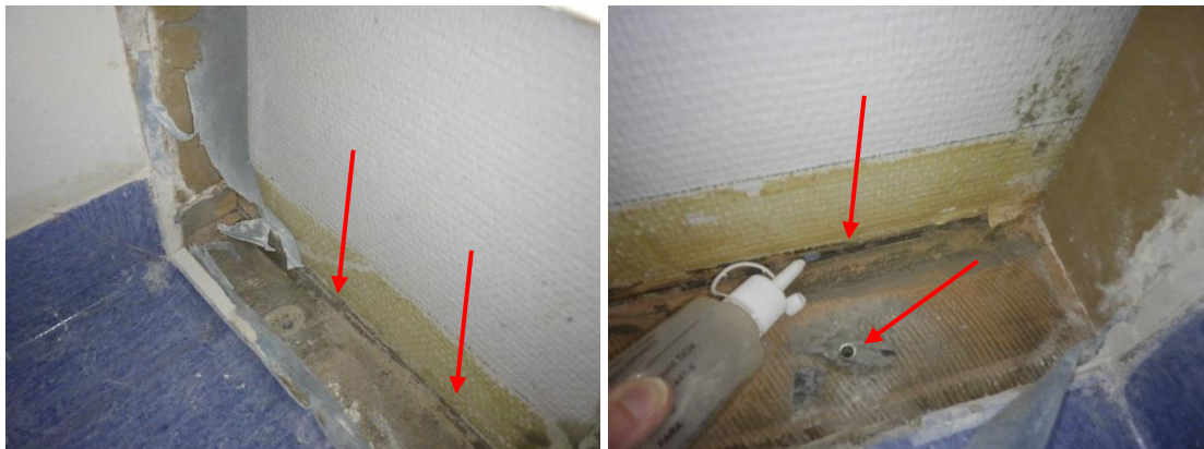
Kuvat 222 ja 223. Ulkoseinän rakenneavaukset R1 ja R2 opettajanhuoneessa 101. Lisäeristekerroksen höyrynsulku on epätiivis. Tilojen normaalilla ilmanvaihdolla, eristetilasta kulkeutuu ilmaa välipohjan ontelon suuntaan kiviaineisen seinä- ja lattiapinnan välissä olevasta raosta sekä lattiassa olevasta puurungon kiinnityskohdasta (nuolet).
