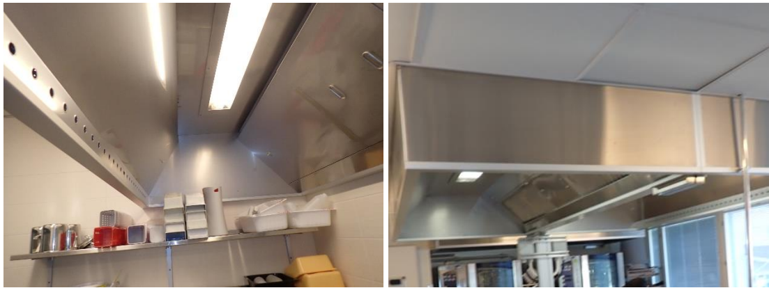
Kuvat 375 ja 376. Yleiskuvat keittiön kondenssihuuvasta (vasen kuva) ja rasvahuuvasta (oikea kuva). Huuvia on keittiössä yhteensä neljä kappaletta ja ne ovat Climecon Oy:n valmistamia.
