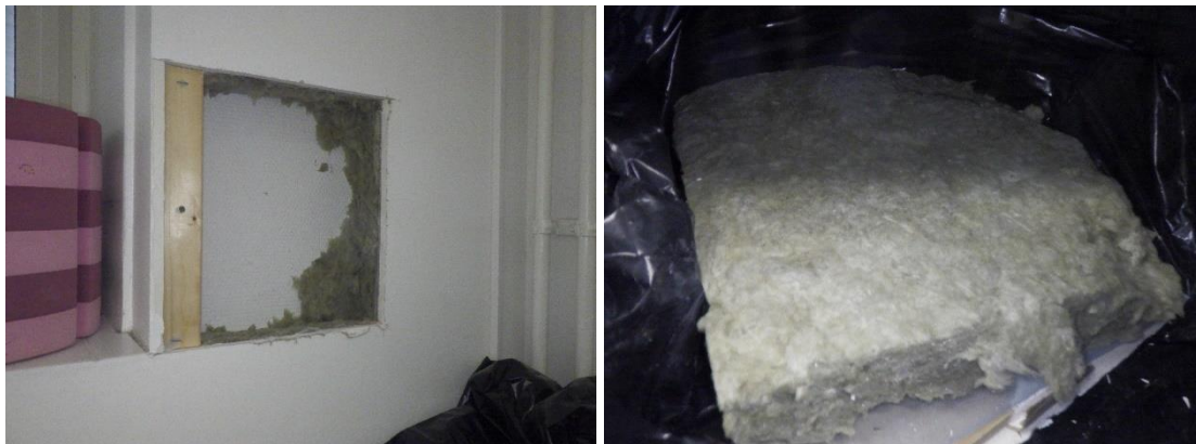
Kuvat 226 ja 227. Ulkoseinän rakenneavaus R6 luokassa 109. Lisäeristekerroksen höyrynsulku ei ole tiivis ikkunapenkin reunalta. Lisäeristeenä olevan mineraalivillan kiviaineista seinää vasten olevassa pinnassa havaittiin tummia pilkkuja, mutta ei viitteitä mikrobikasvusta.
