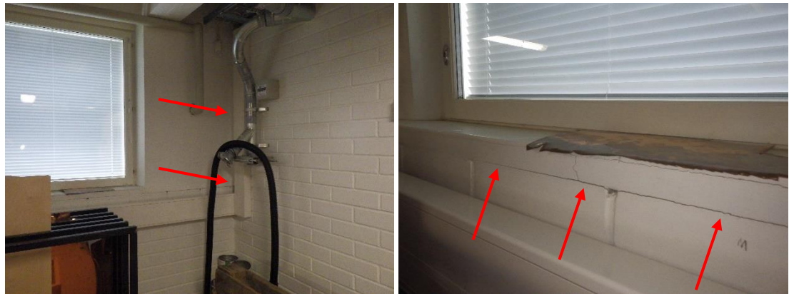
Kuvat 220 ja 221. Ulkoseinän merkkiainekoe MA26 teknisen työn luokkatilassa 031. Kivirakenteisen ulkoseinän eristetilaan sisäkautta syötettyä merkkiainetta havaittiin puurakenteisen ikkunapenkin reunoilla ja kiviaineisen ulkoseinän ja väliseinän liittymässä.
