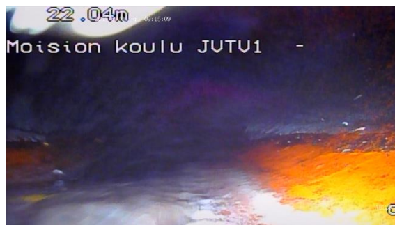
Kuva 378. Jätevesilinja JVTV3 kohdasta, josta alkaa linjan aaltoilu. (kuvaan virheellisesti jäänyt merkintä JVTV1)
