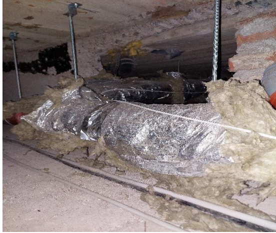
Kuva 63. Ryömintätilassa olevat putkien eristekuoret ovat laajasti rikkoontuneita.
