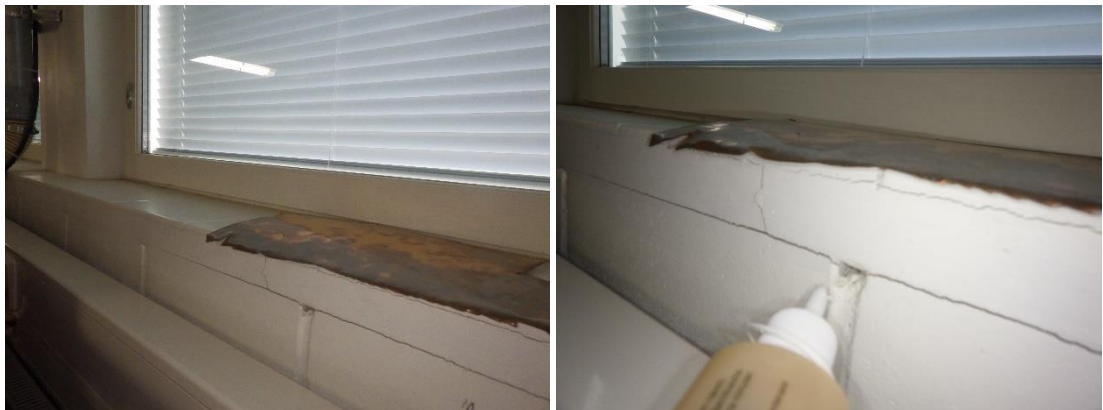
Kuvat 190 ja 191. Teknisen työluokassa puisten ikkunapenkkin yhteydessä havaittiin laajaa epätiiveyttä.
