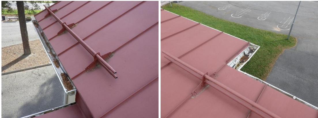
Kuvat 24 ja 25. A-osan matalammassa osassa ja B-osassa sadevesikouruissa havaittiin sulanapito-kaapeleita. Kouruihin on kerääntynyt paikoin runsaasti neulasia.
