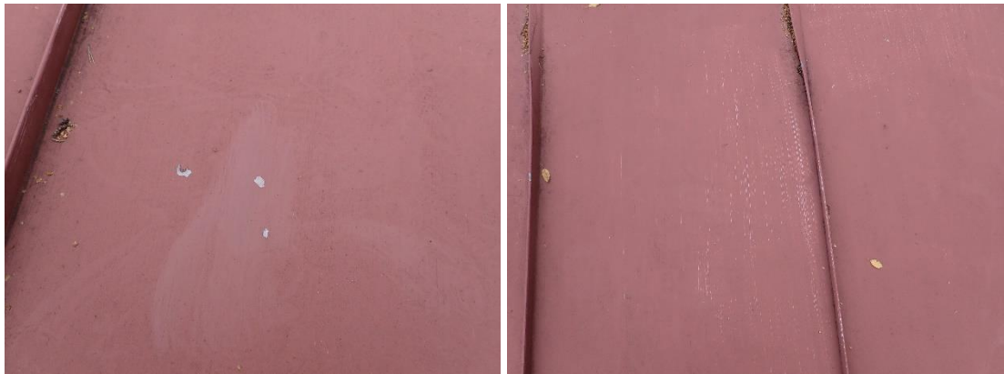
Kuvat 297 ja 298. B-osan katoilla esiintyy jonkin verran pinnoitteen lohkeamia ja keittiön osalla pinnoite on kuultava (ei niin peittävä kuin muilla osilla).
