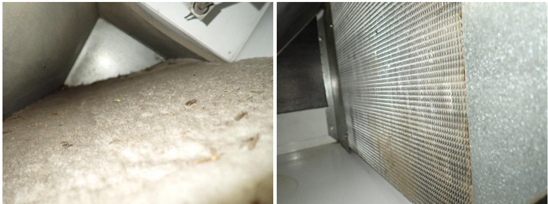
Kuvat 354 ja 355. Yleiskuvat tuloilman karkeasuodattimesta ja lämmityspatterin pinnalta. Karkeasuodatin ja lämmityspatterin ovat ulkopinnoiltaan likaantuneita.
