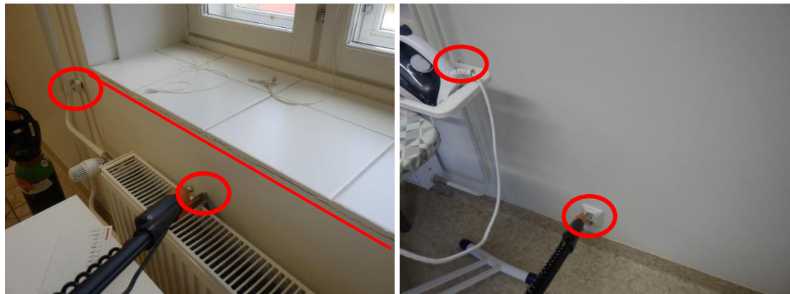
Kuvat 94 ja 95. Merkkiainekoe MA9 luokkatilassa 201. Ulkoseinän sisään kulkeutunutta merkkiainetta havaittiin päätyikkunan kohdalla olevassa ikkunapenkin halkeamassa, ulkoseinällä olevissa patteri- ja lämpöjohtokannakoinneissa sekä parvekeseinällä olevan pistorasian reunoilla. Ikkunapenkin halkeama on merkattu kuvaan punaisella viivalla ja pienemmät epätiiveysalueet punaisilla ympyröillä.
