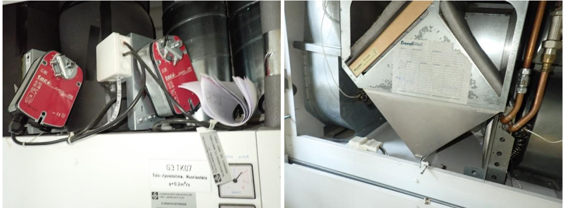
Kuvat 352 ja 353. Yleiskuvat ilmanvaihdon koneesta TK07 suljupelleistä ja LTO-kuutiosta. IV-kone on teknisesti vastaava kuin ilmanvaihtokone TK06.
