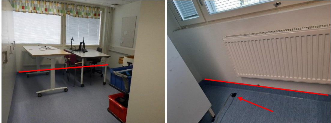
Kuvat 85 ja 86. Merkkiainekoe MA14 toimistotilassa 121. Syöttökohta on merkattu kuvaan punaisella nuolella. Lattialiittymän voimakas vuotokohta on merkattu kuvaan punaisella viivalla.
