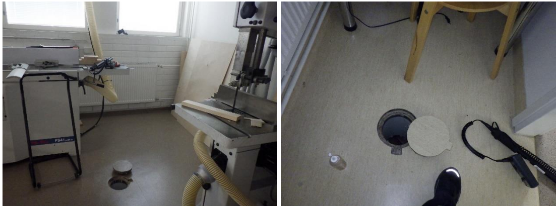
Kuvat 78 ja 79 . Teknisen työn luokkatilojen 030 ja 035 latioissa havaittiin sisäpuolisen salaojajärjestelmän tarkastuskaivoja. Kaivojen kannet ovat epätiivittä ja ilma kulkee huonetiloista salaojajärjestelmän suuntaan.
