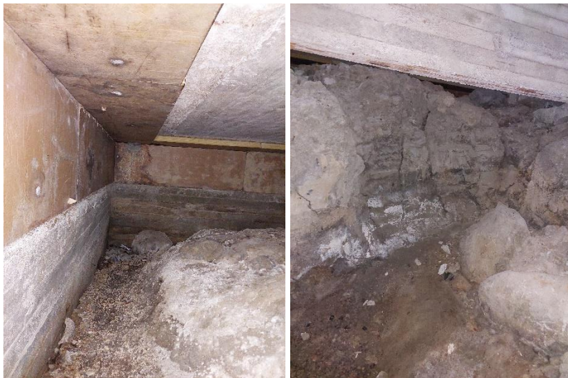
Kuvat 71 ja 72. B-osalla pintavedet kulkuetuvat paikallisesti ryömintätiloihin.
