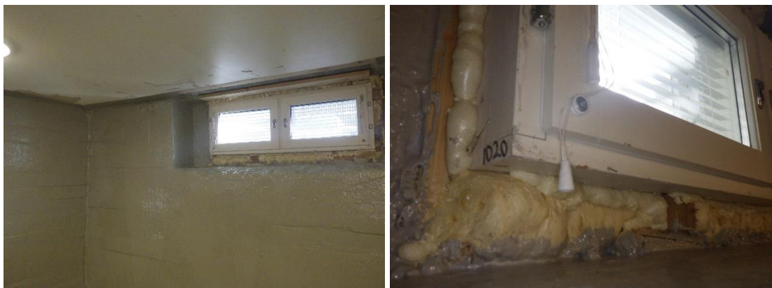
Kuvat 246 ja 247. A-osan tilassa 006 ikkuna on seinässä olevaa aukkoa selvästi pienempi ja sen tilkeväli on laaja. Ikkunaliittymissä ei kuitenkaan todettu selkeitä epätiivelysalueita.
