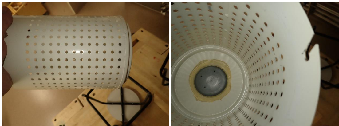
Kuvat 371 ja 372. Yleiskuvat tuloilmaventtiilistä puutyötilasta. Venttiili on siistikuntoinen ja lähes puhdas.
