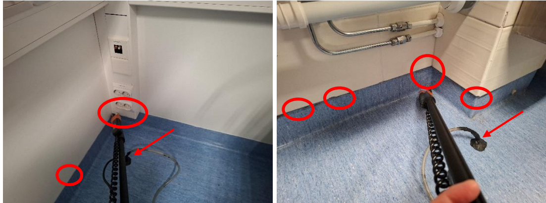
Kuvat 88 ja 89. Merkkiainekoe MA19 luokkatilassa 122. Pistemäisiä vuotokohtia havaittiin ulkoseinän nurkka-alueella (SP1) ja oviseinän vierellä olevan koteloinnin vierellä (SP3). Kotelon kohdalla päästö alapohjasta levisi maton reunan ja laatoituksen välissä. Pistemäiset vuotokohdat on esitetty kuvassa punaisilla ympyröillä ja kaasun syöttöpisteet SP1 ja SP3 punaisilla nuolilla.
