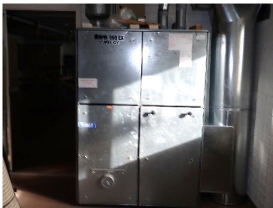
Kuva 377. Yleiskuva puutyötilan purunpoistolaitteistosta. Purunpoistolaitteisto on Ourex Oy:n ÅSS 950 EX, sitä on huoltomerkintöjen mukaan huollettu säännöllisesti.
