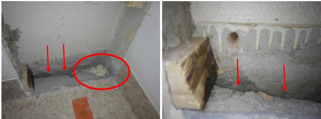
Kuvat 232 ja 233. Ulkoseinän rakenneavaus R20 luokkatilassa 201. Lisäeristeen takana olevan kiviseinän alaosassa havaittiin tummentunutta tasoiterappausta ja vanhoja jalkalistojen porauskohtia. Kiviaineisen seinän ja lattian betonivalun välissä olevasta raosta tapahtuu ilmanliikettä eristetilasta lattiarakenteen sisään luokkatilan ilmanvaihdon normaaliteholla (nuolet). Kiviaineisten rakennekerrosten liittymässä havaittiin uretanieristettä (ympyrä).
