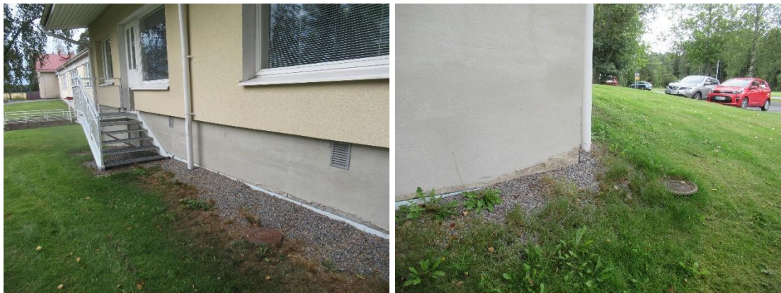
Kuvat 32 ja 33. Patolevytystä havaittiin myös iltapäiväkerhon kohdalla. Patolevytyksen reuna on paikallisesti vierusmaan sorastuksen alapuolella.
