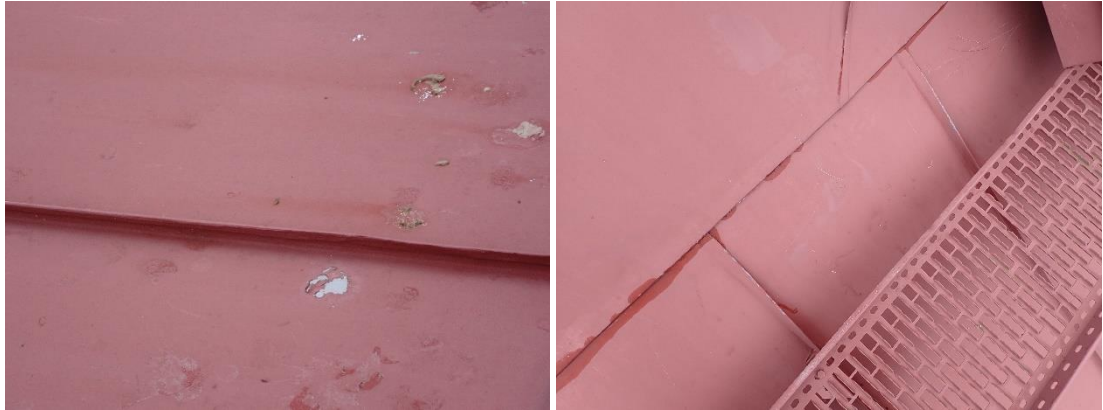
Kuvat 281 ja 282. Vesikatolla havaittiin vähäisessä määrin pinnoitteen vaurioita (pinnoitteen lohkeamia sekä paikallista naarmuuntumista).
