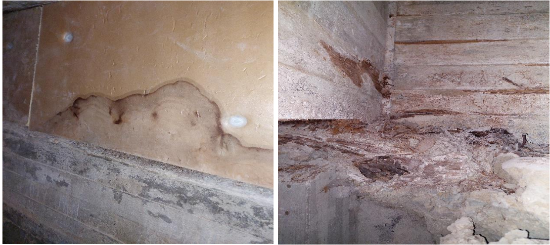
Kuvat 69 ja 70. Ryömintätilojen seinien yläosiin on asennettu uretaanilevytystä. Levyjen paperipinnoissa havaittiin kosteusjälkiä. Paikallisesti ryömintätiloissa havaittiin jäämiä vanhoista muottilaudoituksesta.
