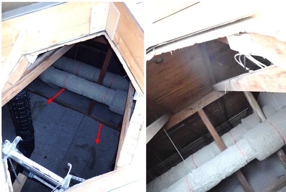
Kuvat 293 ja 294. A-osan matalamman osan kattoluukusta tarkasteltiin yläpohjan kuntoa. Rakenteen vastaava kuin korkeassa osassa. Yläpohjan mineraalivillalevyjen päällä havaittiin paikallisesti irtoneusta (nuolet).
