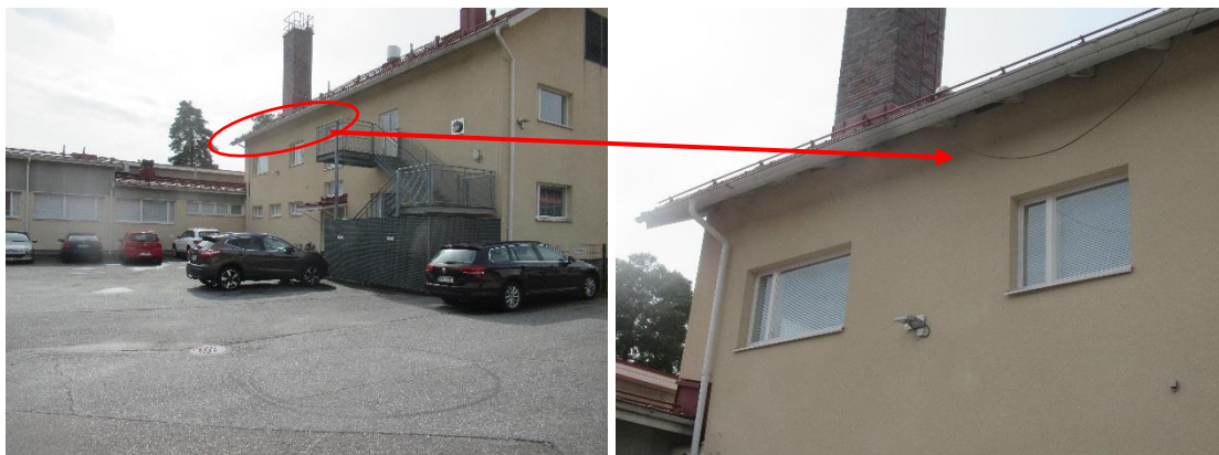
Kuvat 22 ja 23. A-osan korkeammalla osalla, luokan 210 kohdalla, sadevesikourun sulanapitokaapeli on luiskahtanut pois kourusta ja roikkuu räystäällä.
