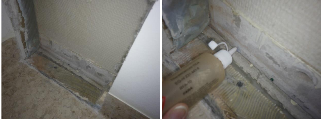
Kuvat 230 ja 231. Ulkoseinän rakenneavaus R19 luokkatilassa 201. Lisäeristeen takana olevan kiviseinän alaosassa havaittiin kohonneiksi arvioituja pintakosteusilmaisimen lukemia. Kiviaineisen seinän ja lattian betonivalun välissä olevasta raosta tapahtuu ilmanliikettä eristetilasta lattiarakenteen sisään luokkatilan ilmanvaihdon normaaliteholla.
