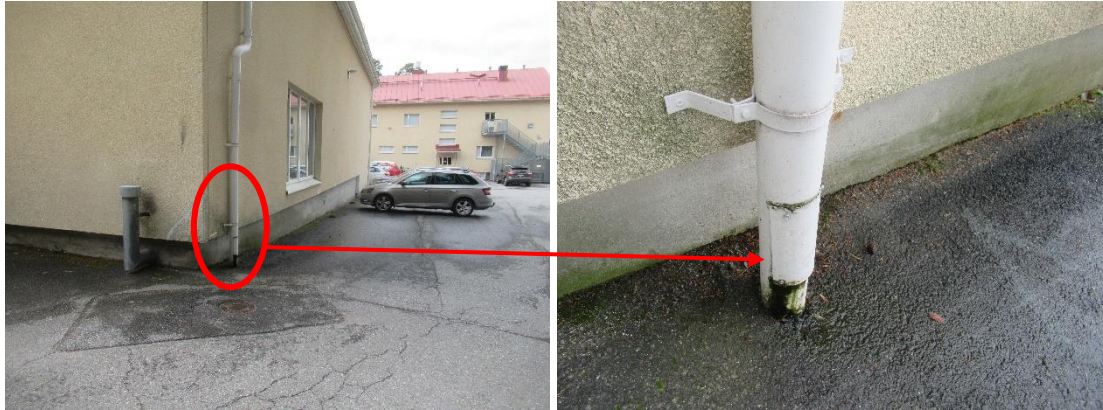
Kuvat 20 ja 21. Ruokalan kohdalla syöksytorvien tarkastusluukuista tulviva vesi kastelee vierustan asfalttipintaa ja rakennuksen sokkeliä. Sokkelissa havaittiin kosteuden aiheuttamaa tummentumaa ja leväkasvua.
