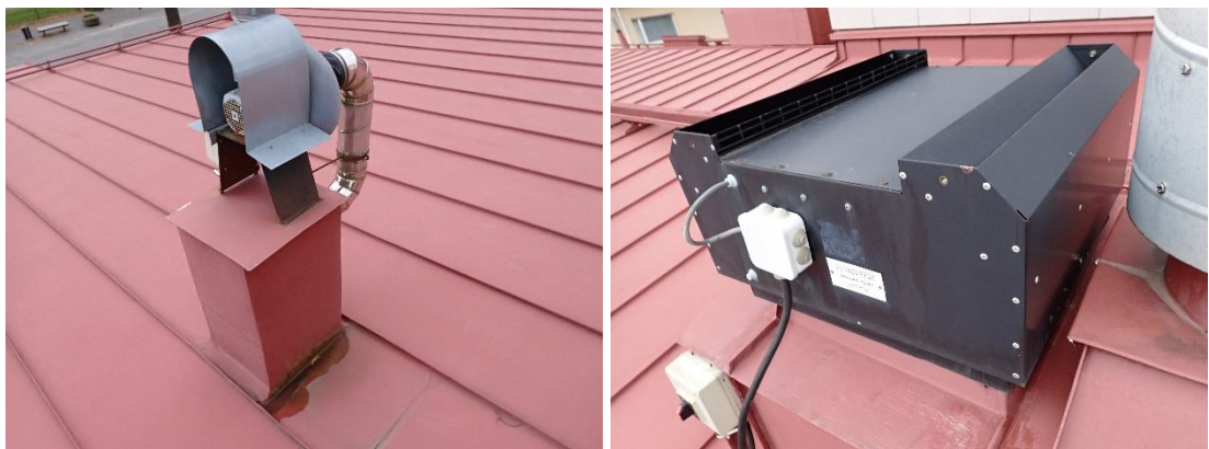
Kuvat 356 ja 357. Yleiskuvat maali- ja ohenninkaapin huippuimurista TK01PF03 (vasen kuva) ja kellarin tiloja palvelevasta huippuimurista TK04PF02 (oikea kuva). WC- ja kellaritilojen huippuimureissa TK01PF02 ja TK04PF02 havaittiin laakerivikaan viittaavaa käyntiääntä.
