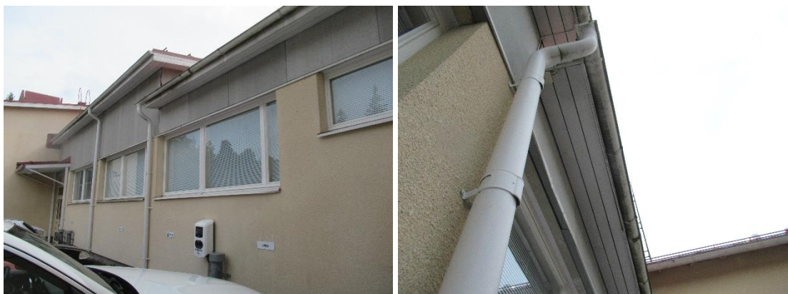
Kuvat 28 ja 29. B-osan matalammalla osalla toimiston 121 ja keittiön kohdalla sadevesikouruissa havaittiin jälkiä ylivuodoista.
