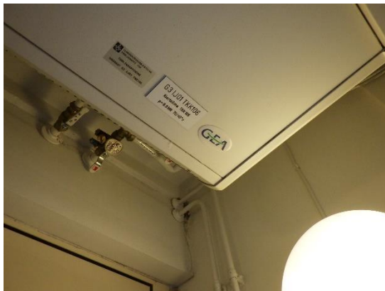
Kuva 360. Kiertoilmakone B-osan tuulikaapissa 118. Kone on vikatilassa ja todennäköisesti tuulikaapissa havaitun poikkeavan, pahan hajun aiheuttaja.
