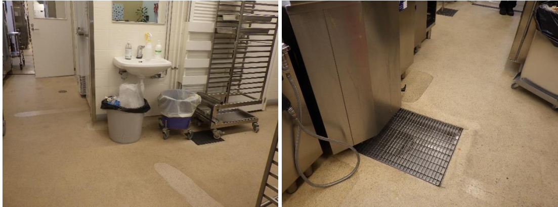
Kuvat 59 ja 60. Keittiön massalattian halkeamia on paikattu aputilojen alueelta. Paikkauksia on tehty myös keittiön lattiakaivojen ympärille.
