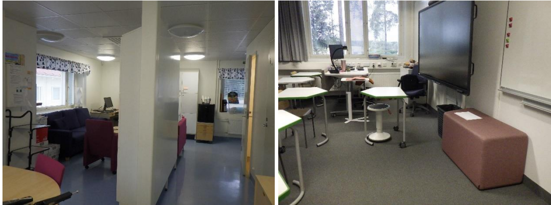
Kuvat 111 ja 112. A-osassa huonetilojen lattiapinnat on päällystetty muovimatolla. Luokan 108 lattiassa ollut tekstiilimatto on poistettu tutkimusten aikana, koulun syyslomalla tehdyssä korjauksessa.
