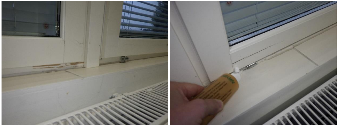
Kuvat 244 ja 245. Luokassa 125 ikkunan alakarmissa havaittiin maalipinnan hilseilyä ja luokassa 136 tuuletusikkunan sisäpuiteen halkeama. Ikkunaliittymät ovat epätiivittä.
