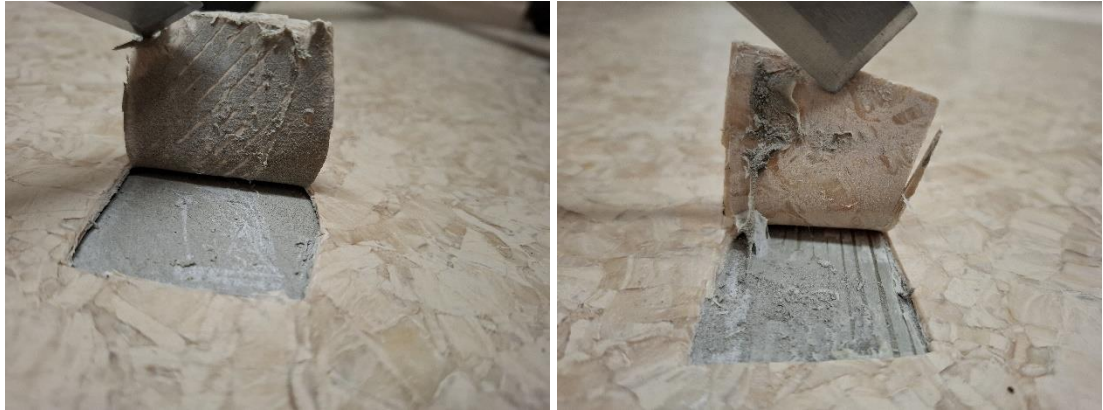
Kuvat 132 ja 133. Tekstiilityöluokan 201 viiltomittauksissa V7 ja V8 suhteellinen kosteus oli koholla lattiapäällysteen alla. Viilloista havaittiin kemiallista hajua.
