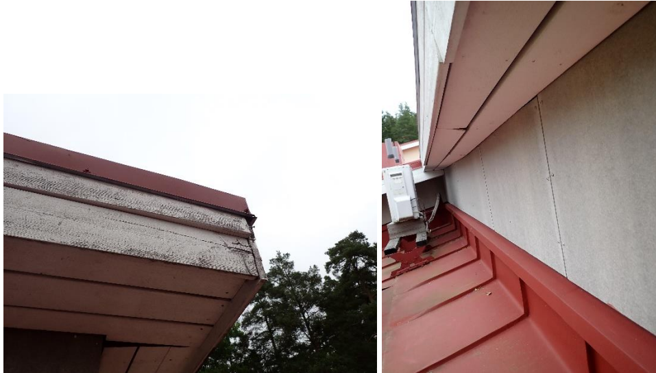
Kuvat 301 ja 302. Ruokalan ja keittiön kohdalla räystäät tuulettuvat lautojen raoista. Laudoitusten pinnoite on kulunut ja paikoin laudoituksien kiinnitys puutteellinen.
