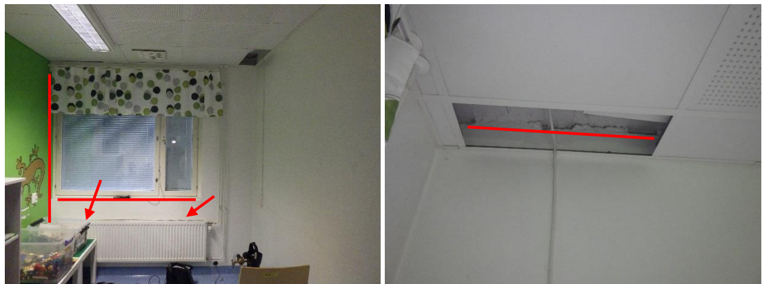
Kuvat 216 ja 217. Ulkoseinän merkkiainekoe MA21 iltapäiväkerhon huonetilassa 142. Kivirakenteisen ulkoseinän eristetilaan sisäkautta syötettyä merkkiainetta havaittiin ulkoseinän ja yläpohjan liittymässä, ulkoseinällä olevissa patterikannakkeissa ja kiviaineisen ulkoseinän ja väliseinän liittymässä.
