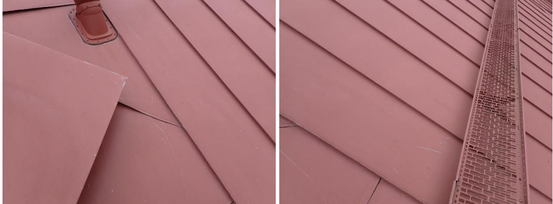
Kuvat 291 ja 292. A-osan matalamman osan vesikaton pinnoitteessa havaittiin joitakin naarmuja.
