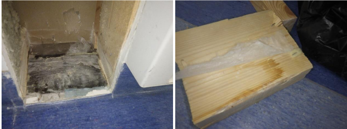
Kuvat 236 ja 237. Puurunkaisen ulkoseinän rakenneavaus R8 käytävällä 124. Puurunkaisen ulkoseinän alla havaittiin kermikaista. Alaohjauspuun yläpinnalla olevan kosteusjäljen alueella ei havaittu poikkeavan korkeaa puunkosteutta piikkikosteusmittarilla tehdyllä tarkastuksella (p% 10).
