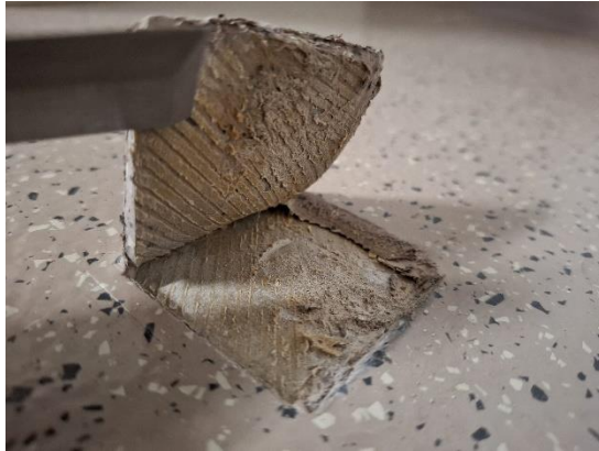
Kuva 73. Puutyöluokan 031 viiltomittauksessa V2 suhteellinen kosteus oli koholla lattiapäällysteen alla. Viillosta havaittiin kemiallista hajua.
