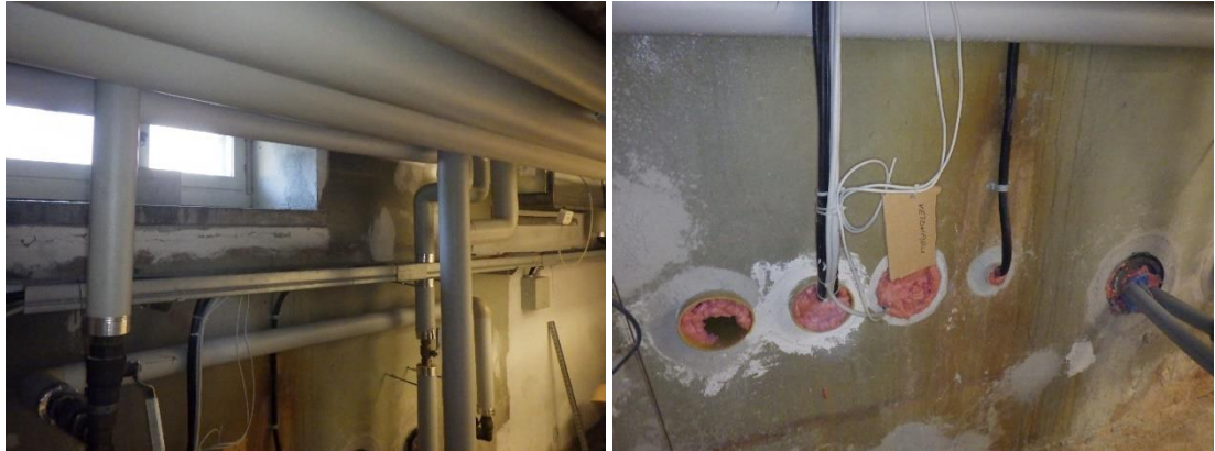
Kuvat 176 ja 177. A-osan kellarin saneeraamattomalla alueella ulkoseinät ovat tasoitettua tiiltä. Seiniä havaittiin epätiivitä läpivientejä.
