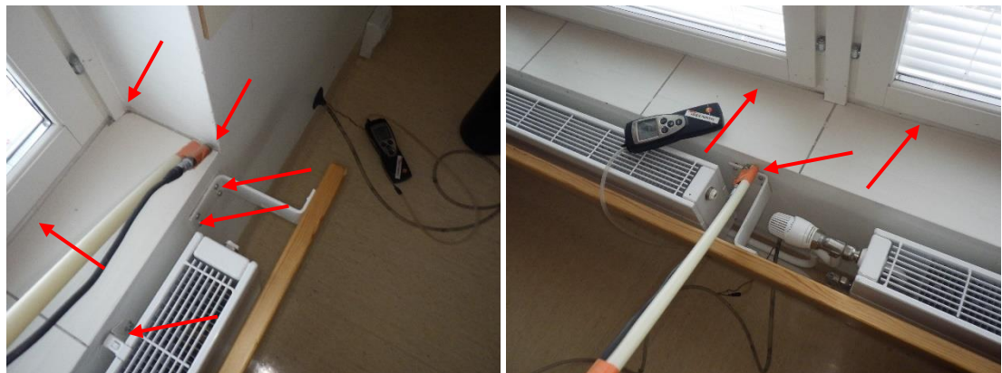
Kuvat 210 ja 211. Ulkoseinän merkkiainekoe MA28 ruokasalissa 133. Kivirakenteisen ulkoseinän eristetilaan sisäkautta syötettyä merkkiainetta havaittiin pistemäisesti lattiialiittymässä ja ikkunan alaliittymässä sekä ulkoseinänurkassa olevan kotelon alareunalla ja seinällä olevissa patterikannakkeissa.
