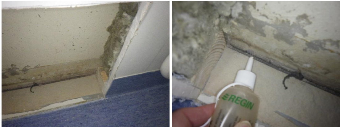
Kuvat 228 ja 229. Ulkoseinän rakenneavaus R7 luokkatilassa 116. Alapohjan ja kiviaineisen ulkoseinän liittymässä havaittiin rako, jonka kautta virtaa ilmaa eristetilasta alapohjan suuntaan tilan ilmanvaihdon normaaliteholla.
