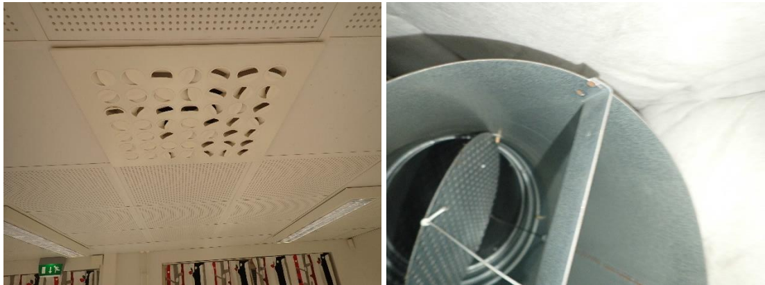
Kuvat 369 ja 370. Yleiskuvat tuloilmahajottajasta ja sen tasauslaatikon sisältä. Tuloilmalaiteet olivat tarkasteluiden perusteella hyväkuntoisia ja lähes puhtaita. Osassa kuten kuvassa olevassa tuloilmaha- jottajassa ilmanvirtausten suutinkuvio ei vastaa laitevalmistajan ohjeistusten mukaisia kuvioita.
