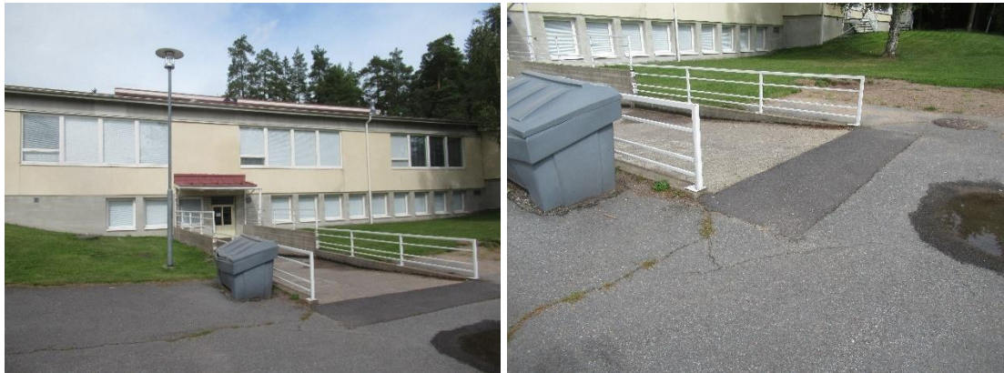
Kuvat 14 ja 15. Teknisten työn luokkatilojen kohdalla pintavesi valuu kohti sisäänkäyntiä kulkuluiskaa pitkin. Luiskan yläpäähän on tiloissa sattuneen vesivahingon jälkeen lisätty pintavesien kulkua estävä asfalttiosuus.
