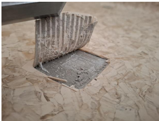
Kuva 131. Tekstiilityöluokan 201 viiltomittauksessa V1 suhteellinen kosteus oli koholla lattiapäällysteen alla. Viillossa havaittiin kemiallista hajua.
