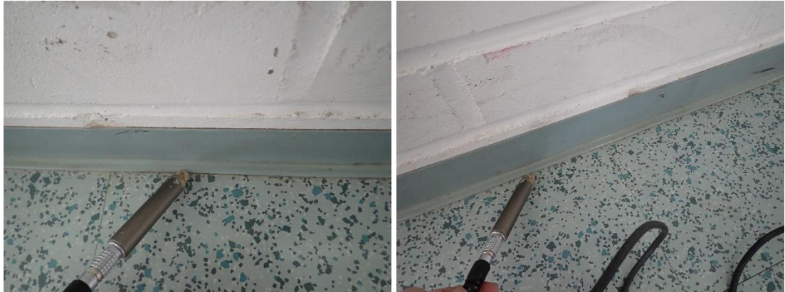
Kuvat 37 ja 38. Vuotokohtia havaittiin lattian ja ulkoseinän liittymästä, lähes koko käytävän matkalla. Vuoto oli runsaampaa kohdissa, joissa jalkalista ei ole lattiapinnoitteen päällä tiiviisti.
