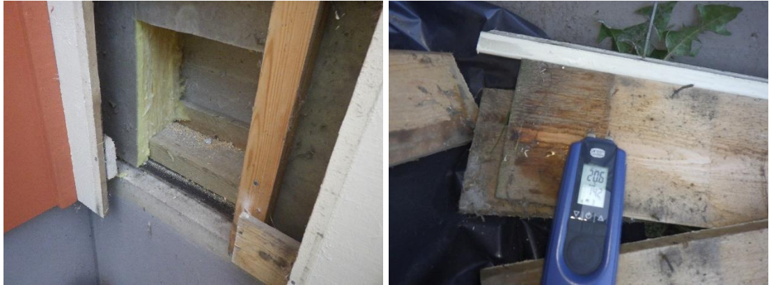
Kuvat 64 ja 65. Rakenneseavaus R3 liikuntasalin pukuhuonetilojen kohdalla. Julkisivuverhouslautojen alaosissa sekä vaakakoolauslautojen ulkopinnoilla havaittiin näkyvää mikrobikasvua. Verhouslautojen alaosat ovat pehmenneitä ja kosteusjälkien kohdalla puunkosteus oli selvästi korkeampi kuin ylempänä rakenteessa.
