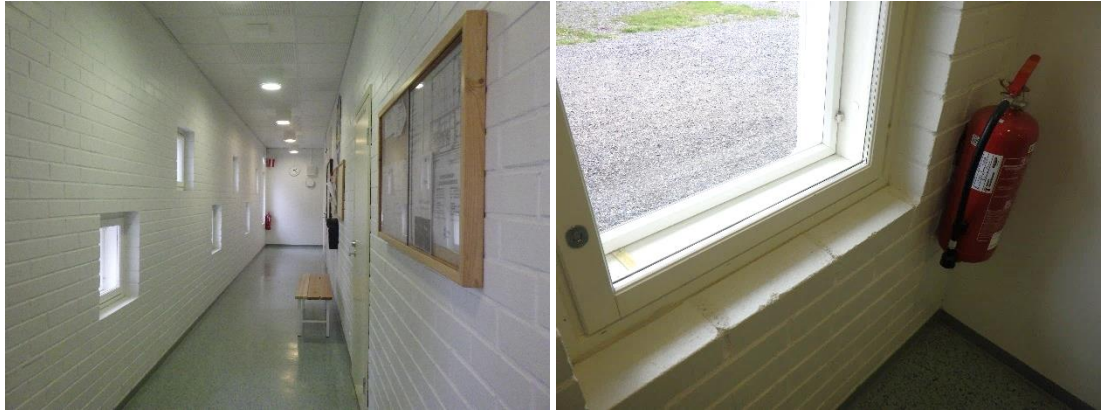
Kuvat 81 ja 82. Käytävällä 103 olevien ikkunoiden liittymissä havaittiin paikallisia epätiivelysalueita.
