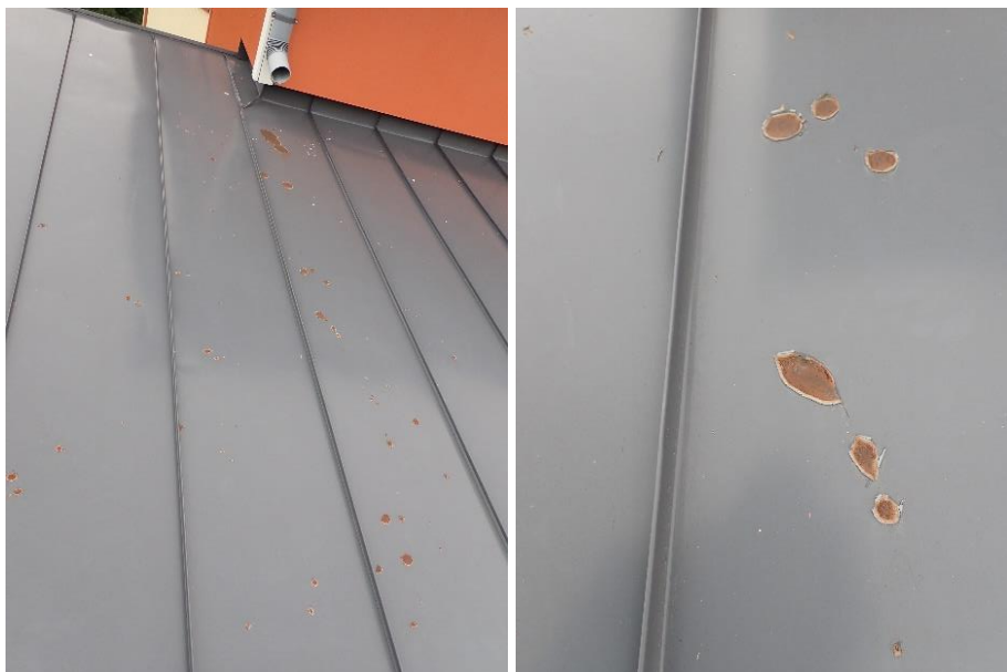
Kuvat 112 ja 113. Kaikilla kateosilla on havaittavissa melko paljon katteen pinnoitteen vaurioita ja näillä kohdin pelti on ruostunut.
