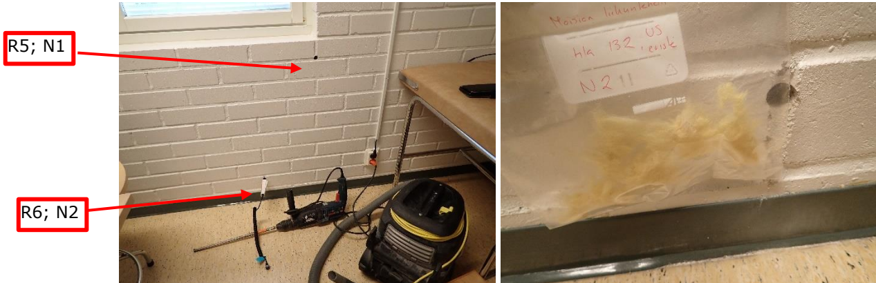
Kuvat 60 ja 61. Rakenneporaukset R5 ja R6, tila 132. Rakenneporauksien kohdasta otettiin ulkoseinän eristeestä näytteet mikrobianalyysia varten (N1 ja N2).
