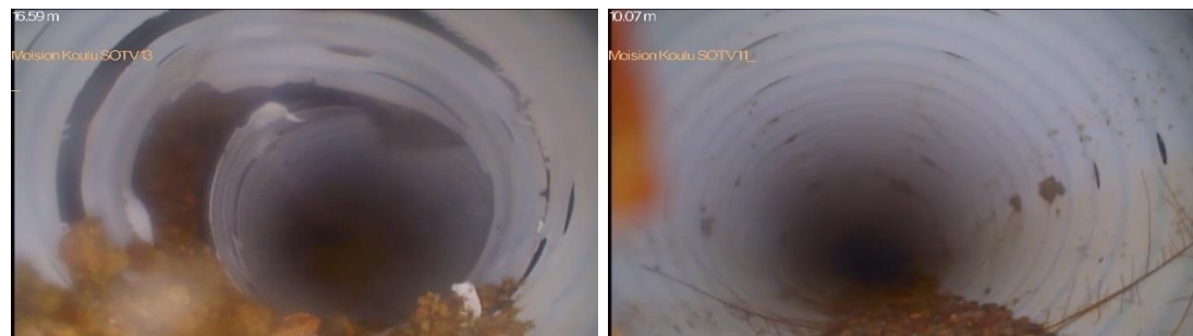
Kuvat 16 ja 17. Vasemmalla kuva SOTV13 linjan rikkoutumisesta. Oikealla kuva SOTV11 linjassa havaituista juurikasvustosta.
