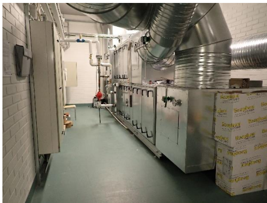
Kuva 140. Yleiskuva ilmanvaihtokoneesta TK01.
