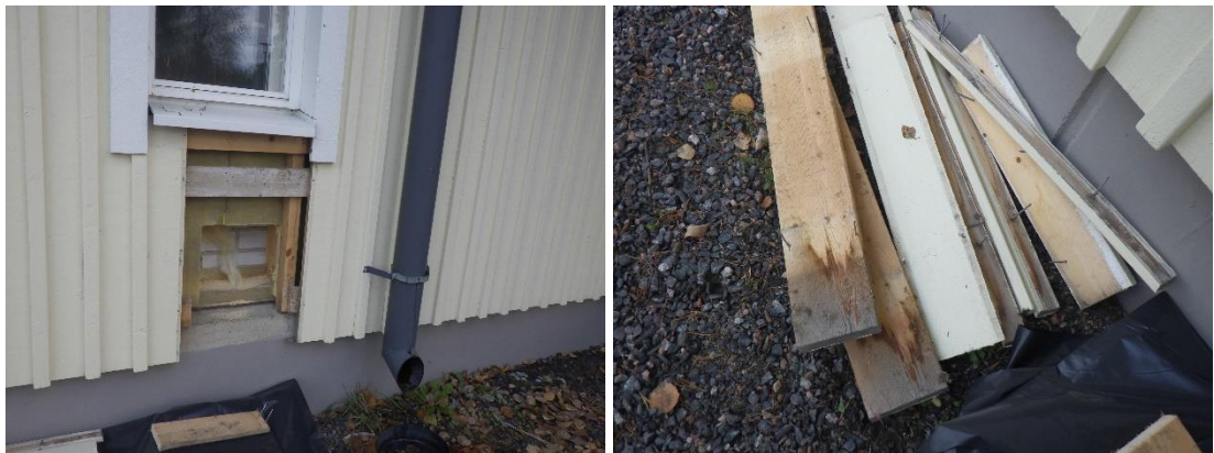
Kuvat 66 ja 67. Rakenneseavaus R4 käytävän 103 kohdalla. Ulkoverhouslautojen taustoissa sekä vaakakoolauksessa havaittiin runsaasti kosteusjälkiä sekä pehmentymää.
