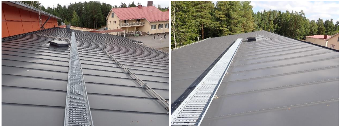
Kuvat 110 ja 111. Vesikatolla on asianmukaiset kulkusillat sekä lumiesteet.
