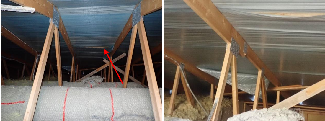
Kuvat 128 ja 129. Aluskatteessa todettiin yksittäinen saumakohta ja yksi alue, jossa aluskatteen kiinnitys on irronnut.
