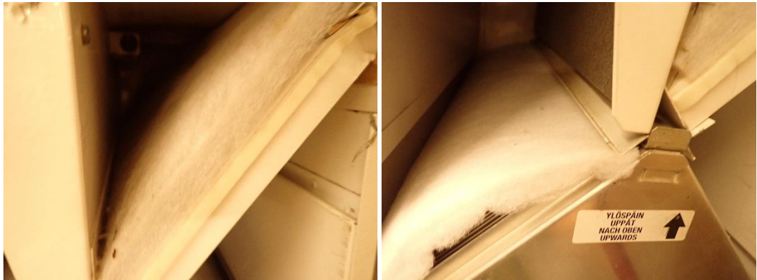
Kuvat 151 ja 152. Yleiskuvat tulo- ja poistoilmasuodattimista. Tulopuolella on karkeasuodatin ja ka-settimallinen suodatin ja poistopuolella pelkkä karkea suodatin. Suodattimet ovat puhtaat.
