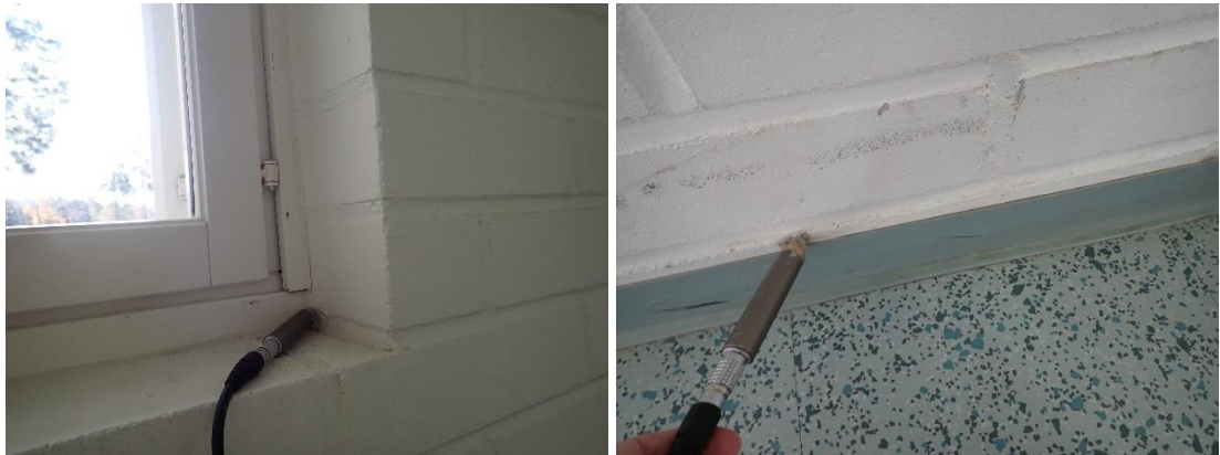
Kuvat 39 ja 40. Vuotoa havaittiin kaasun leviämisen alueella ikkunoiden nurkka-alueilla sekä jalkalistan päältä tiilisauvojen kohdilla.
