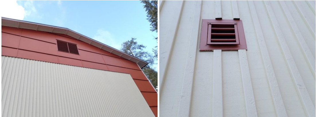
Kuvat 163 ja 164. Yleiskuvat ulkoilmasäleiköistä. Vasemmassa kuvassa on ilmanvaihtokoneen TK01 ulkoilmasäleikkö ja oikeassa kuvassa TK02 ulkoilmasäleikkö.
