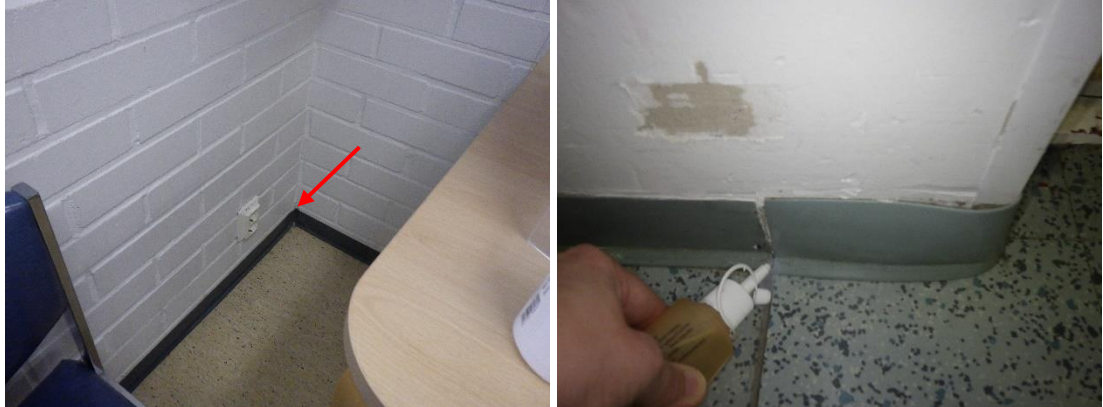
Kuvat 22 ja 23. Ulkoseinänurkkien kohdalla jalkalistan takaa havaittiin tapahtuvan ilmanliikettä huonetilan suuntaan. Käytävällä 103 väestönsuojan edessä olevan käytävän lattia on pieneltä alueelta levytetty. Levytetyn lattian alta tapahtuu ilmanliikettä lattiasta huonetiloihin.
