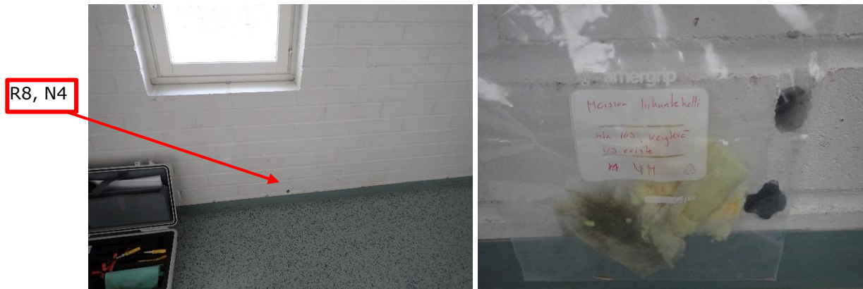
Kuvat 70 ja 71. Rakenneavaus R8, käytävä 103. Rakenneavauksen kohdalta otettiin ulkoseinän eristeestä näyte mikrobianalyysia varten (N4).
