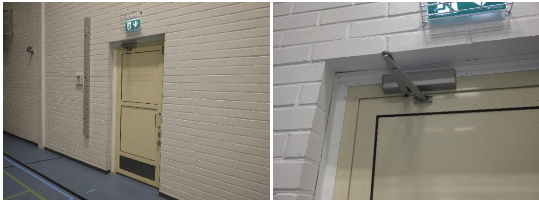
Kuvat 87 ja 88. Huolto-ovien liikuntasalin puoleisilla pinnoilla havaittiin paikallisia kolhuja. Oviin on asennettu ovipumput.
