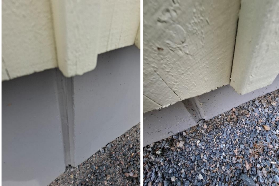
Kuvat 9 ja 10. Sokkeleiden saumakohtiin on asennettu elastinen massa. Rakennuksen itäpäädyssä saumamassassa havaittiin halkeilua.
