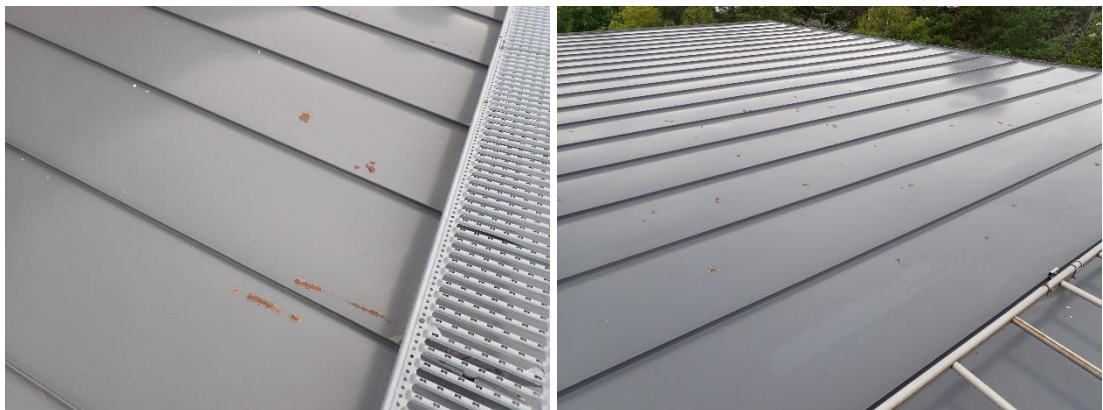
Kuvat 114 ja 115. Katteen pinnoitteen vaurioita on koko katolla ja näillä kohdin pelti on ruostunut.
