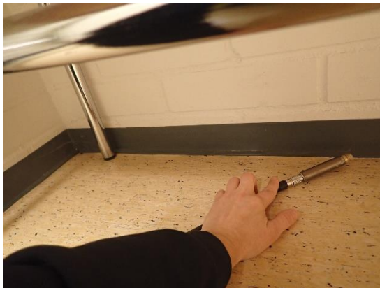
Kuvat 33. Vuotoa havaittiin myös väliseinän ja lattian liittymästä jossa jalkalista ei ole tiiviisti kiinni lattiapinnoitteessa (listan ja maton saumassa rako).
