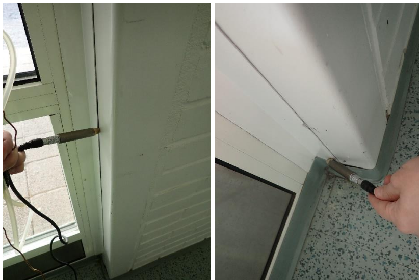
Kuvat 41 ja 42. Vuotoa havaittiin ulko-oven liittymistä.
