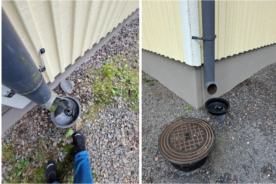
Kuvat 13 ja 14. Rakennuksen pohjoisreunalla olevaan sadevesisyyöksyyn on asennettu sulapitokaapeli. Muissa syöksytorvissa ei havaittu sulapitokaapeleita.
