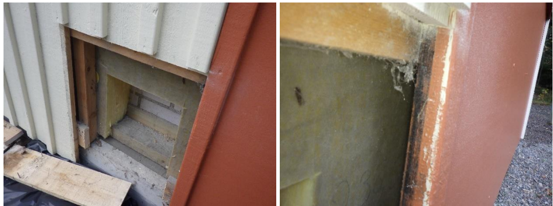
Kuvat 62 ja 63. Rakennearaus R2 liikuntasalin varastojen kohdalla. Ulkoseinän rakenne vastaa avauksen R1 havaintoja. Julkisivuverhouksautojen alaosissa sekä vanerijulkisivun reunalla olevan puulistan syrjässä havaittiin näkyvää mikrobikasvua.
