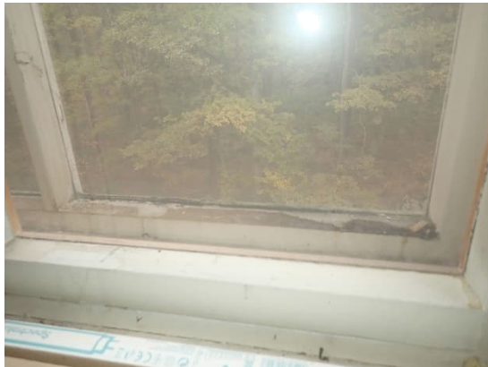
Kuva 262. Tilan 210 ikkunoiden lasivälissä on viitteitä sinne tiivistyvistä kosteudesta.
