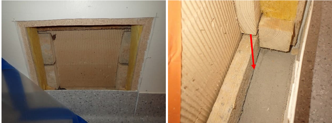
Kuvat 234 ja 235. Varaston 221 kylmään sivuvinttiin rajautuvan ulkoseinän alareunan avaus R40. Seinässä oli uudet sisäpuolen eristeet, koolaus ja levytys, muuten rakenteet olivat alkuperäiset. Seinän alareunan vanhan laudoituksen ja lattiatasoitteen välistä todettiin ilmavirtausta huoneen suuntaan (nuoli).
