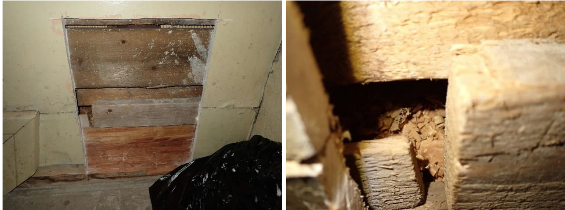
Kuvat 237 ja 238. Varaston / käytävän 209 kylmään sivuvinttiin rajautuvan ulkoseinän alaosan avaus R30. Seinän alaosassa näkyy suoraan laudoituksen takana yläpohjan eristettä. Seinän alaosassa havaittiin kosteuskätkiä (nuoli). Kaikki avauksesta irrotetut materiaalit haisivat PAH-yhdisteiltä.
