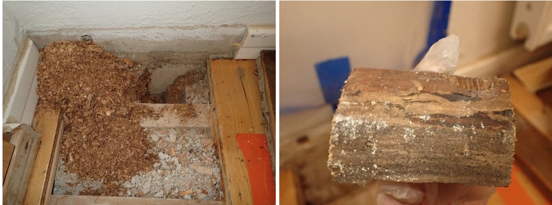
Kuvat 60 ja 61. Teknisentyön luokan lattian avaus R1. Kutterinlastueristeen todettiin tummuneen ja puurungon betonin vasten oleva alapinta oli pehmentynyt ja siinä havaittiin näkyvää mikrobikasvua.
