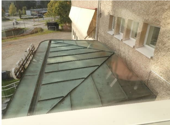
Kuva 330. Kirjaston pääsisäänkäynnin katos on peltiä ja siinä oli jonkin verran ruostetta.
