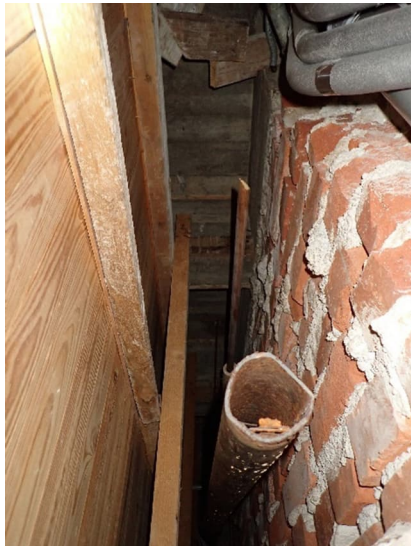
Kuvat 309, 310 ja 311. Avaus R33 tehtiin käytävän 206 väliseinällä olevaan kotelointiin. Koteloinnin pohjalla oli runsaasti rakennusjätettä ja koteloinnissa katkaistuja putkia.
