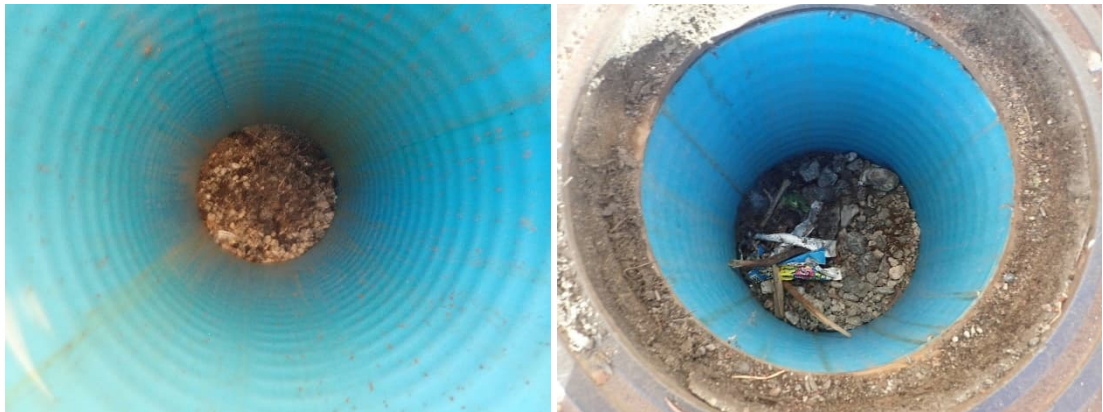
Kuvat 14 ja 15. B-osan etelän puoleisten salaojakaivojen pohjalla oli runsaasti sepeliä ja roskaa. C-osan kaakkoiskulmassa olevassa tarkastuskaivossa oli jonkin verran hiekkaa.
