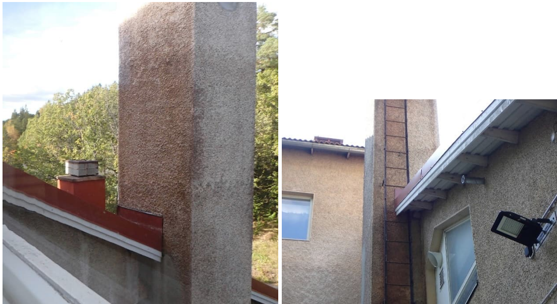
Kuva 328 ja 329. A-osan ja vesikaton ja piipun liittymä on vuotanut ja katolle vievät tikkaat ovat räystäään sisällä.
