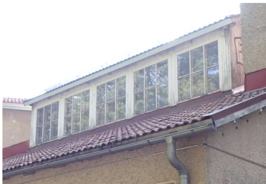
Kuva 213. B-osan itäpäädyn pieni lautaverhottu julkisivun osuus. Laudoituksen alaosissa havaittiin tummumista.
