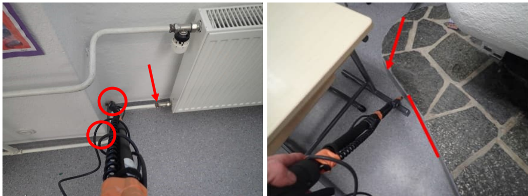
Kuvat 82 ja 83. Vasemmanpuoleisessa kuvassa opetustilan syöttöpisteen SP1 edustalla olevan patterisyvennyksen vuotopaikat maton ylösnoston yläosasta. Nuolella esitetty pistemäinen vuotokohta. Oikeanpuoleisessa kuvassa takan edustan vuotopaikat, viiva on yhtenäisempi vuotokohta.
