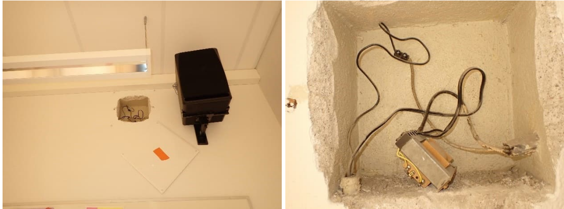
Kuvat 303 ja 304. Poistetun kaiuttimen kohta on pellitetty ja takana on vanhat sähköjohdot. Pellityksen takana aistittiin PAH-yhdisteiden hajua. Kuvat avauksesta R37.
