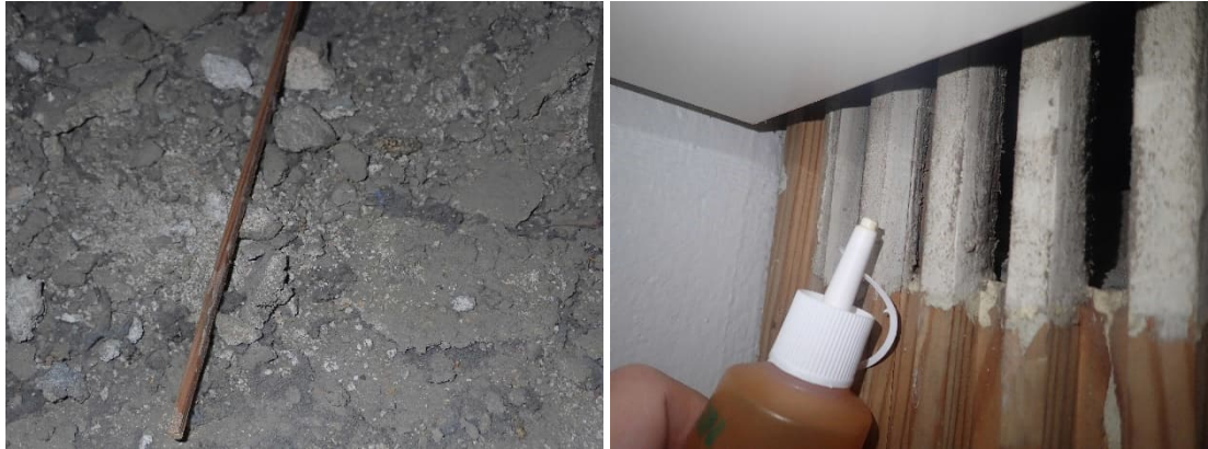
Kuvat 419 ja 420. Hormien pohjilla havaittiin hormoneista irronnutta laastia. Hormeihin, joiden kautta virtasi ilmaa ulospäin oli kertynyt jonkin verran pölyä.
