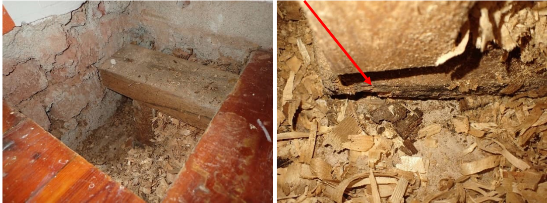
Kuvat 64 ja 65. Konesalin lattian avaus R3. Puurungon alaosaan havaittiin lahoa (nuoli).
