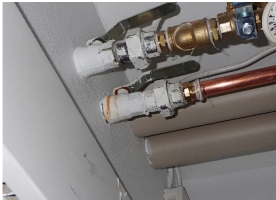
Kuva 286. Kuraattorin ja terveydenhoitajan eteisen katon lämmittimen putken venttiili on vuotanut hieman seinäpinnalle.
