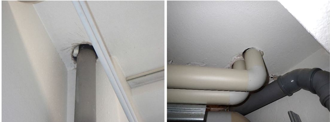
Kuvat 165 ja 166. Teknisentyönluokan maalaushuoneen ja sen takana olevan pienen huoneen katon (välipohjan) epätiivait läpivientejä.
