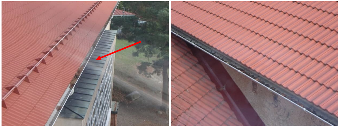
Kuva 342 ja 343. C-osan räystäskouruissa oli roskaa. Vasemmanpuoleisessa kuvassa näkyy liikuntasalin erkkerin peltikate (nuoli).
