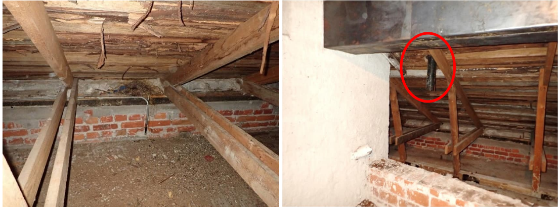
Kuva 356 ja 357. B-osa vintin lattialla oli jonkin verran purua ja rakennusjätettä asennustöistä. Lisäksi oli katkaistuja viemärintuuletusputkia (ympyrä).
