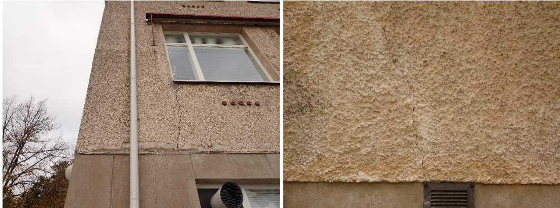
Kuvat 205 ja 206. Rappauksessa oli jotain näkyviä halkeamia, kuvat ovat A-osan etupihan puolelta ja C-osan itäpäädyistä.
