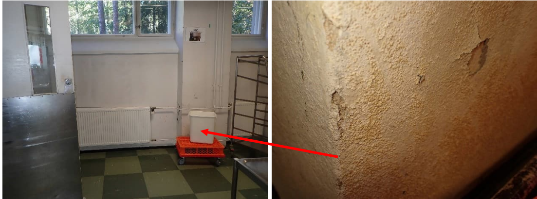
Kuvat 224 ja 225. Ruokalan seinän alaosassa on biojäteastian takana roiskeita ja mahdollista mikrobikasvua seinäpinnalla.
