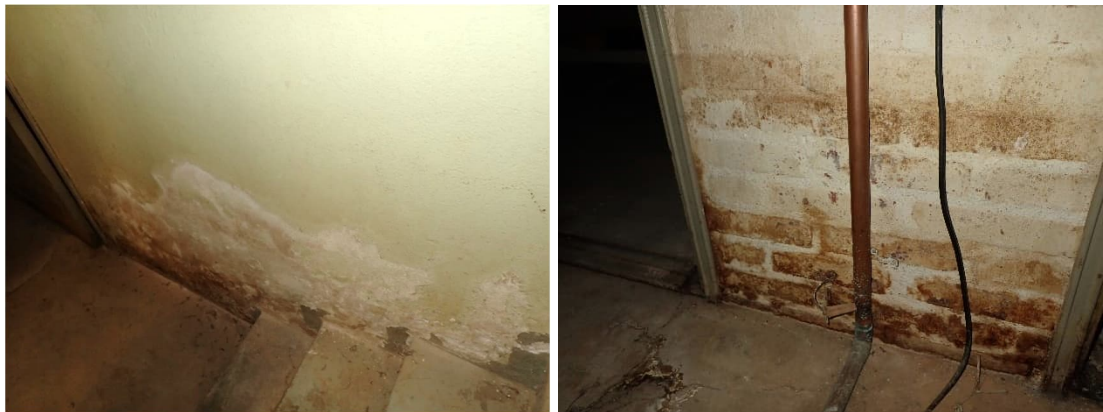
Kuvat 275 ja 276. Alimman kellarikerroksen väliseinien alaosien kosteusvaurioita takapihanpuoleisen entisen asunnon läheisyydessä ja alla.
