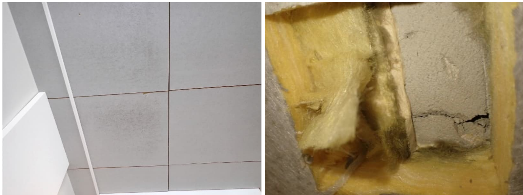
Kuvat 156 ja 157. Iltapäiväkerhon katon akustiikkalevyjen poikkeavaa tummumista ruokalan välioven edustalla. Akustiikkalevyjen takana havaittiin isoja halkeamia.
