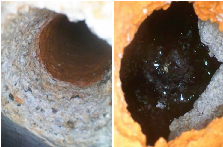
Kuvat 190 ja 191. Alimman kellarikerroksen maanvastainen ulkoseinä entisen kattilahuoneen kohdalla, poraus P14. Pikisively betonin sisäpinnassa.
