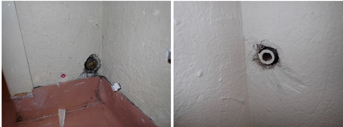
Kuvat 241 ja 242. Ikkunoiden välissä paksun seinän kohdalla on katkaistuja tulppaamattomia lämpöjohtoja. Läpivientien kautta tapahtui paikoitellen ilmavirtausta joko rakenteen tai huoneen suuntaan.
