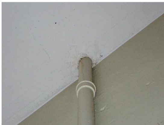
Kuva 366. Liikuntasalin esiintymislavan kohdalla kosteusjälkiä viemärin tuuletusputken läpiviennin ympärillä.
