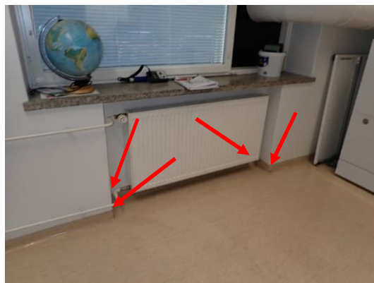
Kuva 80. Kuraattorin huoneen patterisyyten kohdalla todettiin ilmavuotoa alapohjasta muovimaton ylösnostosta rakenteen sisä- ja ulkonurkissa. Lisäksi todettiin paikallisia vuotokohtia muualla maton ylösnostosta reunalta. Mattoa raottamalla vuotokohtia oli laajemmin.
