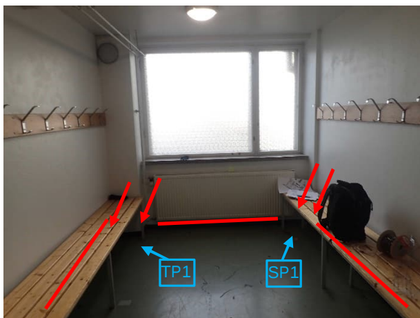
Kuva 84. Poikien pukuhuoneen alapohjan merkkiainekokeen MA8 havaitut ilmapuotopaikat on merkitty punaisilla nuolilla. Yhtenäiset vuotokohdat on esitetty kuvassa punaisella viivalla. Kaasun syöttöpisteet on merkitty sinisillä nuolilla.
