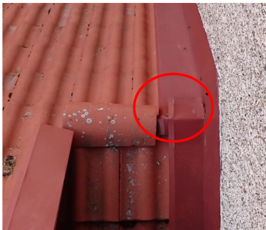
Kuva 337. B-osan matalan osan liittymä korkeaan osaan, pellityksen jatkos harjalla vaikuttaa epätiiviltä (ympyrä).
