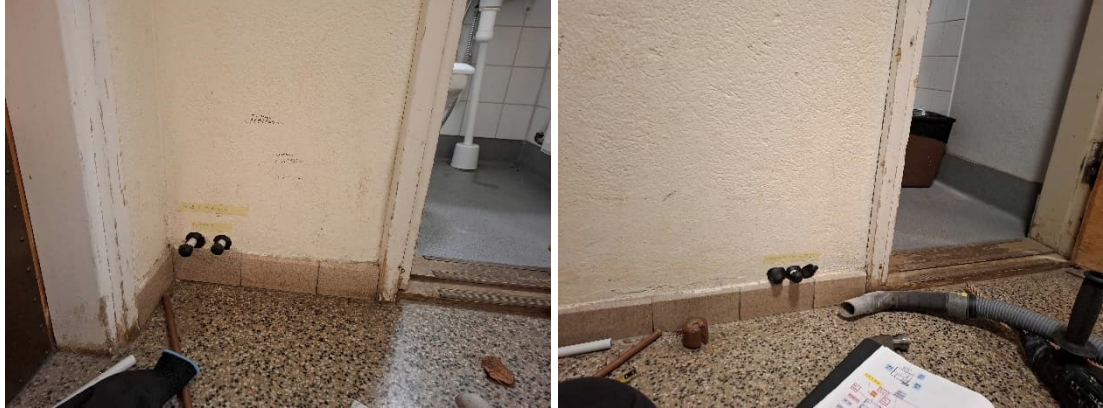
Kuvat 293 ja 294. Pukuhuonekäytävän väliseinän kosteusmittapisteet MP20 ja MP21.
