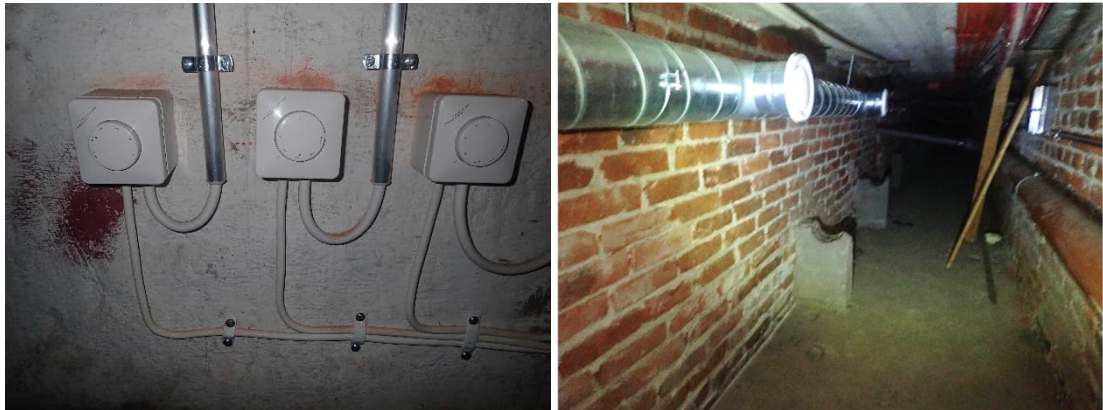
Kuvat 405 ja 406. Kanavapuhaltimien tyristorit. Putkikanaalien poistoilmaelimiä.
