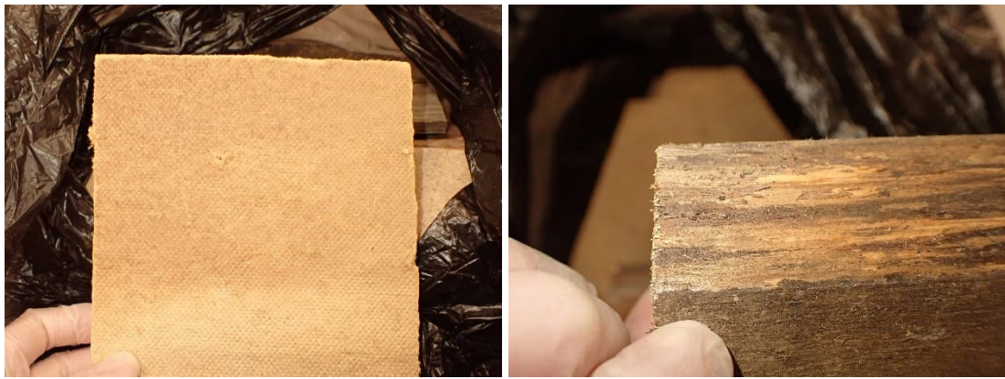
Kuva 371 ja 372. Varaston 221 puurakenteisen yläpohjan avauksessa R41 todettiin värimuutosta ja poikkeavaa hajua puukuitulevyssä ja mahdollista mikrobikasvustoa laudassa. Kummassakin materiaalissa todettiin suoramikroskopoinnilla sienikasvustoa.
