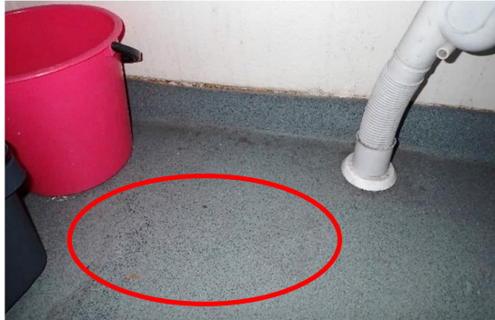
Kuva 121. Siivouskomeron 109 lattiassa todettiin paikallisesti koholla olevia kosteusarvoja ja samalla kohdin maton seinäylösnosto oli irronnut seinästä.
