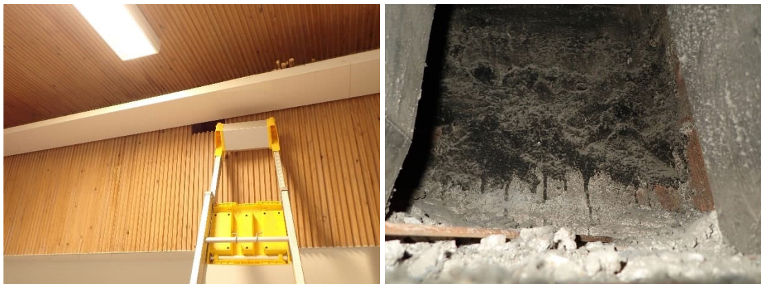
Kuvat 305 ja 306. Käytävän 206 koteloinnin avaus R34 ritilä kohdalta. Takana oli painovoimaisen ilmanvaihdon hormi, josta virtasi ilmaa käytävän suuntaan.
