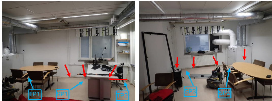
Kuva 78 ja 79. Kuraattorin huoneen alapohjan merkkiainekeksen MA1 havaitut ilmavuotopaikat on merkitty punaisilla nuolilla. Punaisella viivalla on esitetty laajempi muovimaton ylösnostosta vuotokohta. Kaasun syöttöpisteet (SP) ja tarkastuspisteet (TP) on merkitty sinisillä nuolilla.
