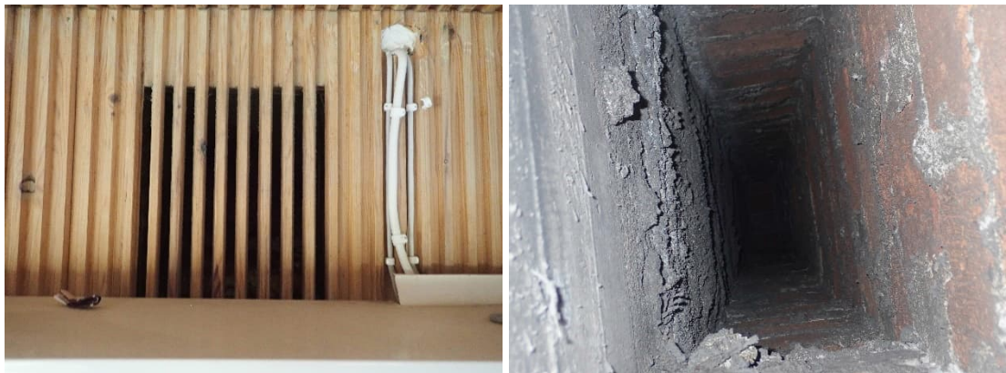
Kuvat 417 ja 418. Painovoimaisen ilmanvaihdon ritilä paneloidussa koteloinnissa. Ritilä on yhdistetty ulkoilmaan tiilihormin kautta.
