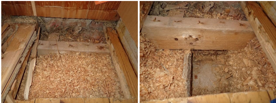
Kuvat 62 ja 63. Teknisentyön luokan lattian avaus R2. Puurungon alapinnan kosteus oli hieman koholla.
