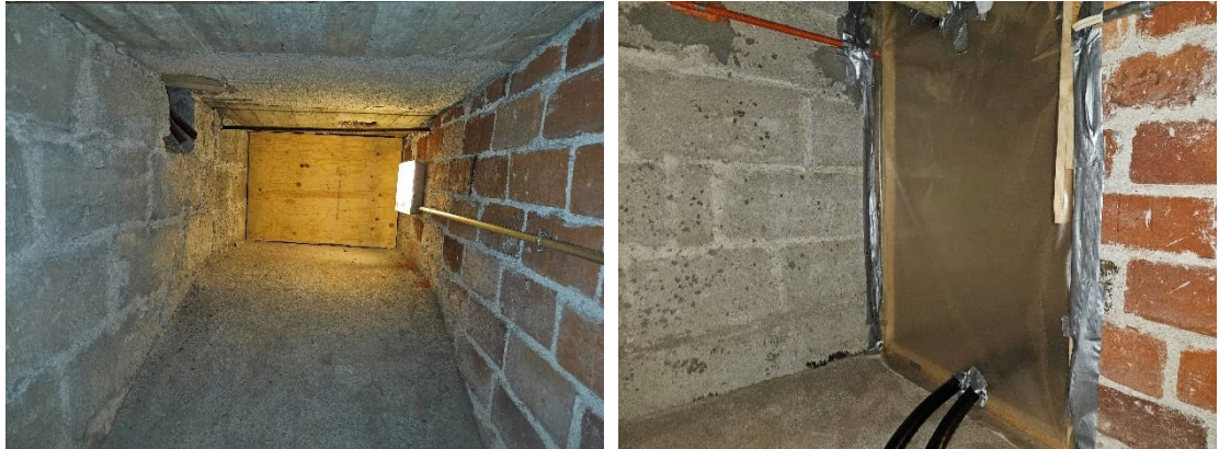
Kuvat 90 ja 91. Kanaalin sivuhaaroja oli ummistettu vanerilla ja rakennusmuovilla.
