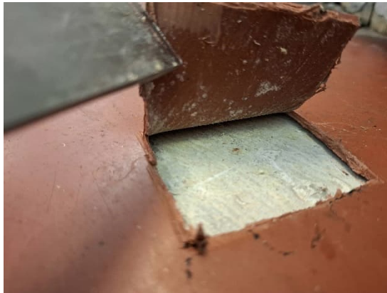
Kuva 54. Emännän huoneen viiltomittaus MP6. Muovimaton alta tuli mikrobikasvustoa, joka oli heikosti kiinni alustassa.
