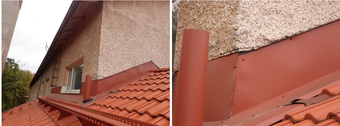
Kuva 326 ja 327. A-osan vesikaton peltiylösnoston liittymä B-osan ulkoseinään oli epätiivis.
