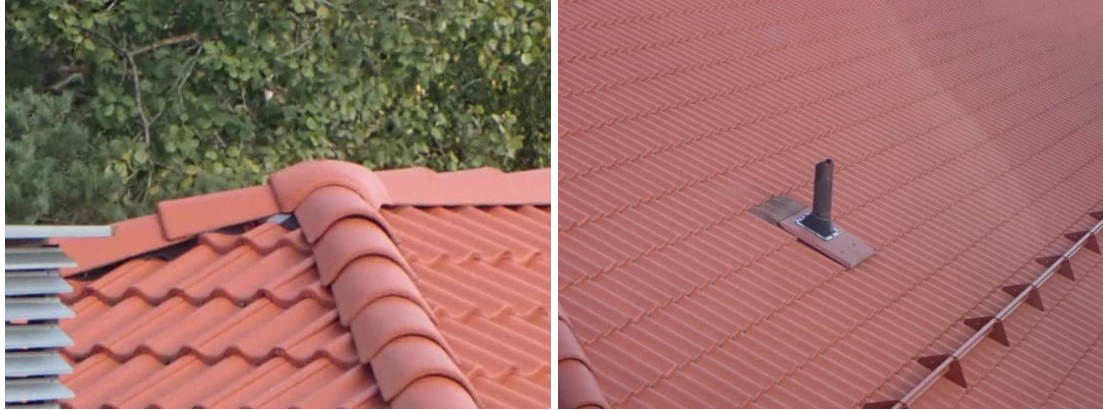
Kuva 340 ja 341. C-osan harjalla havaittiin mahdollista epätiiveyttä B-osan puoleisessa päädyssä. Viemärin tuuletusputki oli ruosteessa.
