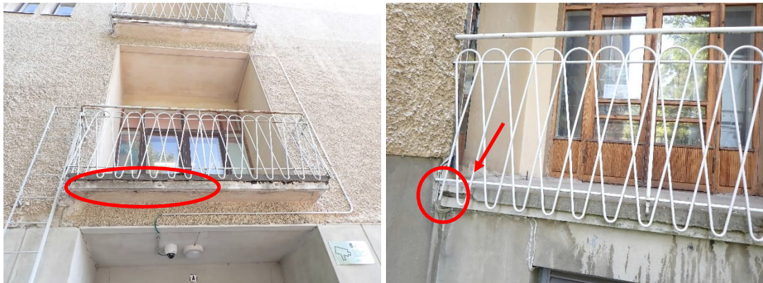
Kuvat 211 ja 212. Parvekelaattojen otsa- ja alapinnoissa havaittiin joitain esiin tulleita rautoja ja lohkeavaa betonia (ympyrät). Pieliseinien alaosien rappaukset lohkeilivat paikoin (nuoli).
