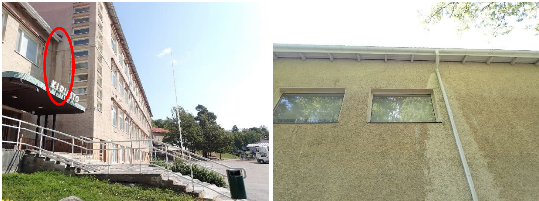
Kuvat 207 ja 208. A- ja B-osan liittymässä ja C-osan takapihanpuoleisella sivulla on kosteusjälkiä julkisivuissa.
