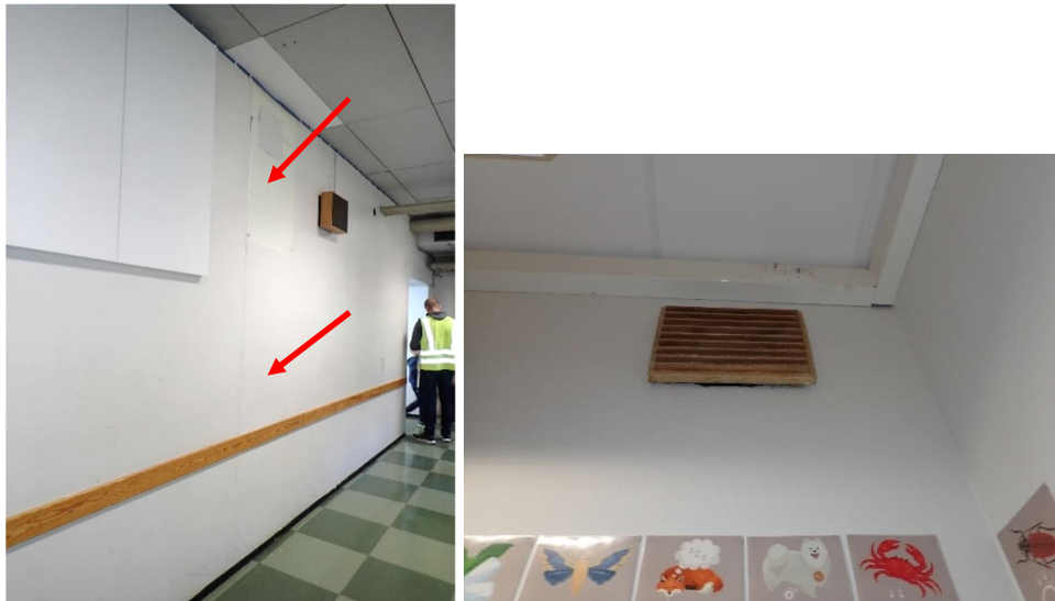
Kuva 267 ja 268. Väliseinässä on pellitys hormin kohdalla, nuoli. Oikeanpuoleisessa kuvassa on luokahuoneen väliseinään upotettu vanha kaiutin. Osa kaiuttimista on poistettu ja aukko seinässä on pellitetty.
