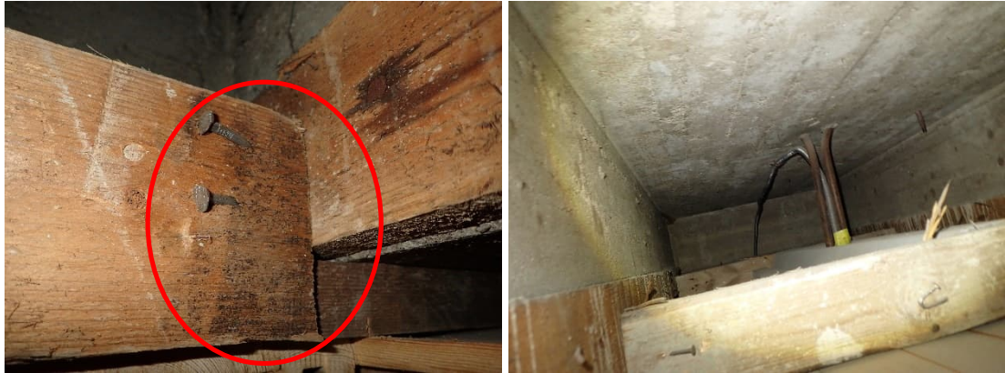
Kuva 367 ja 368. A-osan käytävän 230 alakaton avaus R38. Alakaton puurungossa oli näkyvää mikrobikasvua (ympyrä). Yläpohjan sähköläpiviennit olivat valussa, kohdan tiiveyttä ei yletty tarkastamaan.
