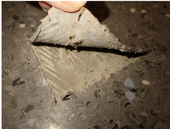
Kuva 57. Ruokalan käytävän viiltomittauksen MP2.2 kohdalla ei havaittu poikkeavaa hajua ja liima oli tavanomaista.
