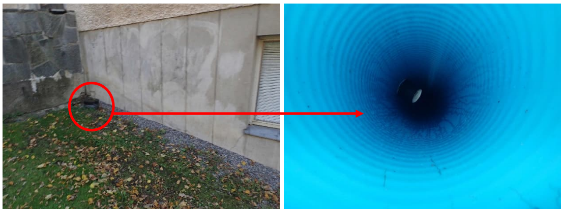
Kuvat 10 ja 11. Kirjaston portaан vieressä oleva salaojan tarkastuskaivo.
