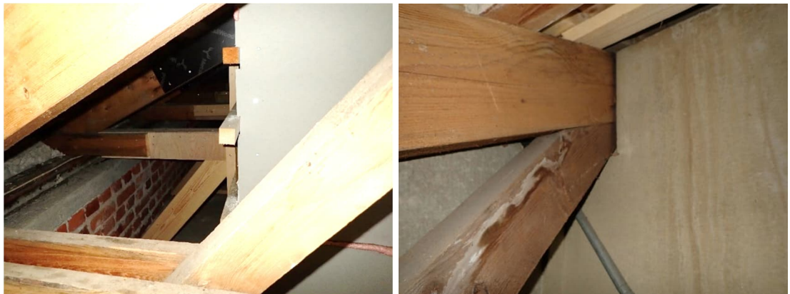
Kuva 351 ja 352. A-osan itäpuolen sivuvintin 217 seinälevy on uusittu kipsilevyksi ja komerot estävät liikkumisen tilassa. Länsipuolen seinälevyt ovat kuitusementtilevyä, ja niissä sekä katon kannatin puissa havaittiin kosteusjälkiä.
