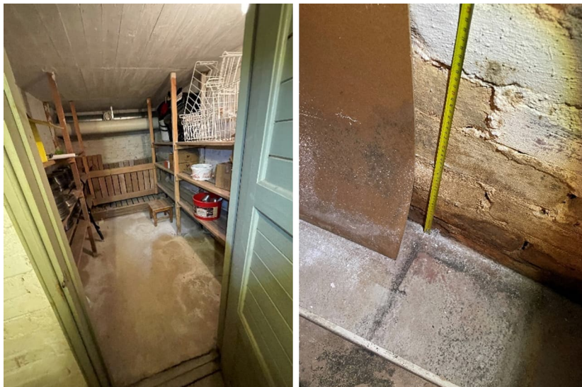
Kuvat 39 ja 40. A-osan entisen asunnon alla sijaitsevan alimman kellarikerroksen alapohjassa oli paikoin kalkkihärmää ja todennäköistä mikrobikasvua.
