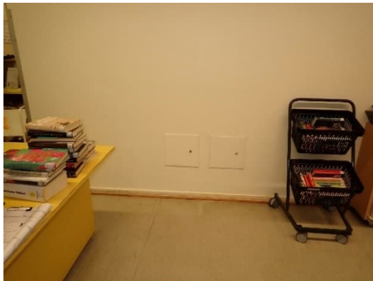
Kuva 279. Kirjaston väliseinässä oli lukut, joiden reunoilta virtasi ilmaa kirjaston suuntaan ja ilman mukana tuli poikkeavaa hajua.
