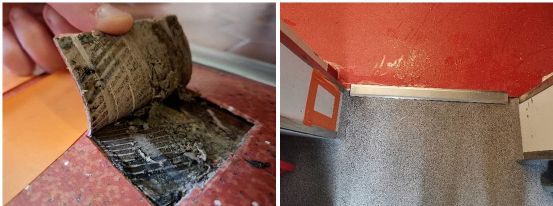
Kuvat 50 ja 51. Keittiön käytävän viiltomittaus MP3, näkyvää mikrobikasvua muovimaton alla ja voimakas mikrobiperäinen haju mattoa avattaessa. Keittiön tiloissa käytetään ajoittain runsaasti vettä.
