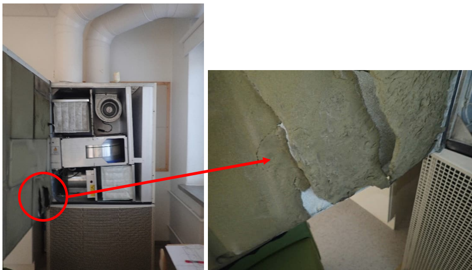
Kuvat 399 ja 400. Koneiden kansissa olevat vaahtomuovit olivat useissa koneissa rikkonaisia.
