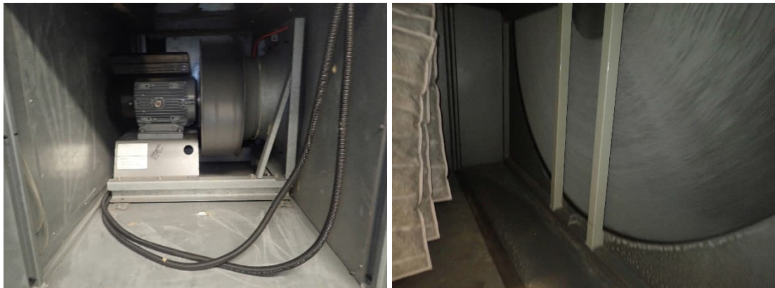
Kuvat 385 ja 386. Puhaltimet ovat suoravetoisia ja lämmöntalteenotto on toteutettu pyörivällä kennolla.
