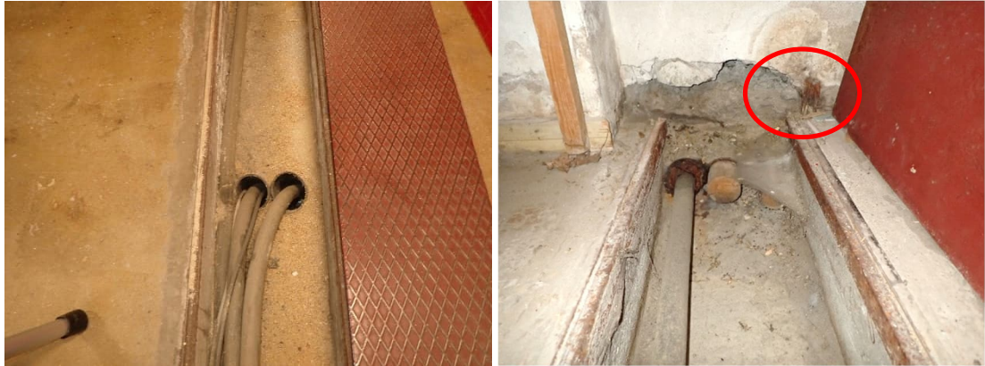
Kuvat 68 ja 69. Lautavaraston lattiassa oleva kouru, avaus R5. Kaapeleiden ja suojaputkien välit ovat tiivistämättä ja ilma virtasi huoneesta alapohjan / putkikanaalin suuntaan. Maanvastaisen seinän läpivientien tiivistykset on tehty uretaanivaahdolla ja puulla, ilmaa virtasi paikallisesti huoneen suuntaan. Seinää vasten oli lahonnut puun pala (ympyrä).
