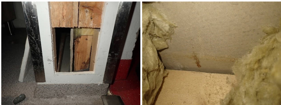
Kuvat 299 ja 300. Keittiön takavaraston avaukset R12 ja R13. Uusi koolaus ja kipsilevytys on asennettu vanhan rakenteen päälle. Avauksista todettiin runsasta ilmavirtaa huoneen suuntaan ja ilmavirran mukana aistittiin tulevan mikrobiperäistä hajua.
