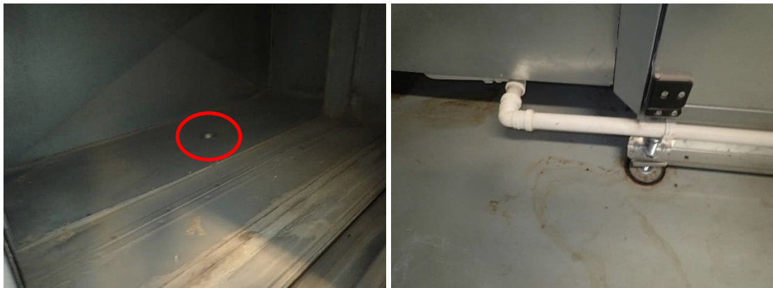
Kuvat 389 ja 390. Ilmanvaihtokoneen kondenssivedet on viemäröity ilmanvaihtokonehuoneen lattia-kaivoon.
