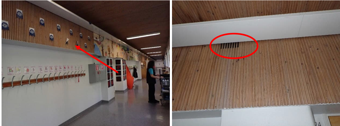
Kuvat 269 ja 270. B-osan käytävillä on väliseinän yläosassa tekniikkakotelo (nuoli), jonka sisällä on paikoitellen painovoimaisen ilmanvaihdon hormoneja, jotka erottuvan ritilöinä paneelipinnassa (ympyrä).
