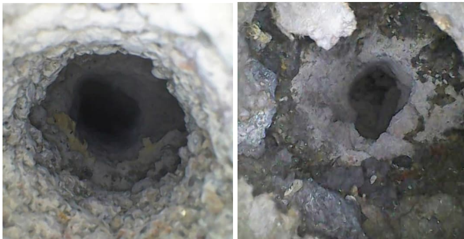
Kuvat 28 ja 29. Ruokalan alapohjan rakenne väliseinän vierellä ja keskemällä huonetta, poraukset P13 ja P34. Eristeenä on keskemällä huonetta koksinkuonaa ja kevytbetonia (P34). Väliseinän vierellä (P13) ei havaittu eristettä.
