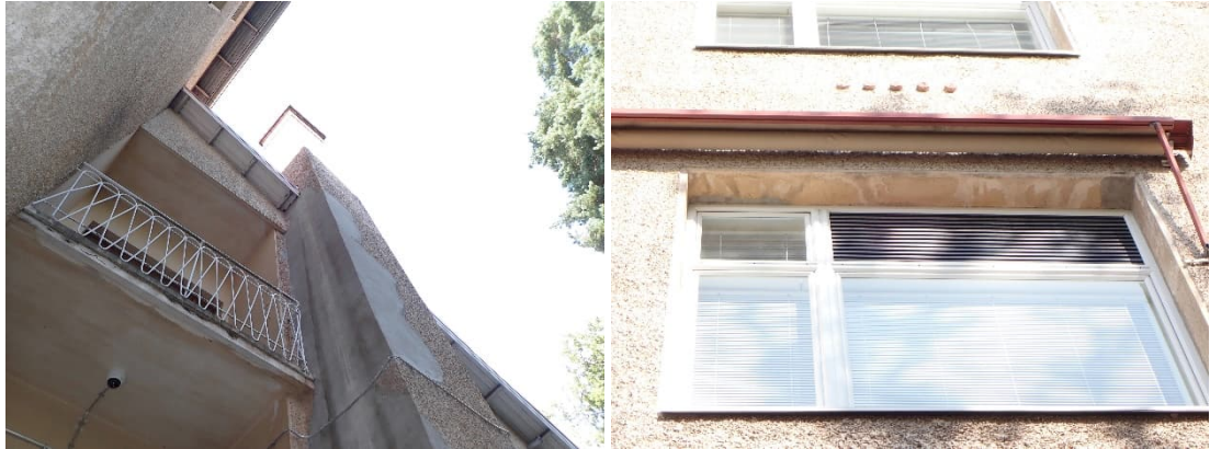
Kuvat 209 ja 210. A-osan piipun ja räystään liittymässä havaittiin vesivuoto. B-osan ikkunoiden yläpielissä havaittiin kosteusjälkiä.
