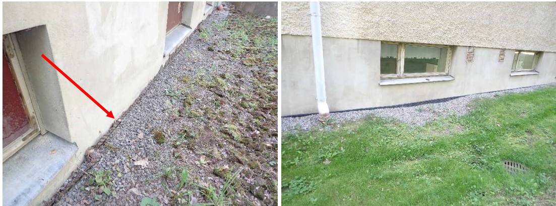
Kuvat 6 ja 7. C-osan takapihan puolella oleva patolevytys on yläreunastaan auki (nuoli). B-osan patolevytyksen yläreunassa on listoitusta.
