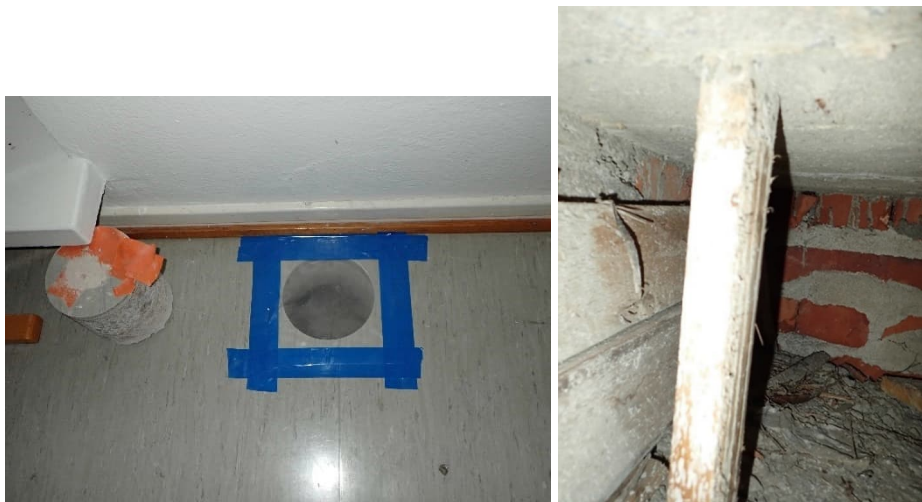
Kuvat 140 ja 141. Kirjaston taukotilan 112 välipohjan avaus R29. Huoneen ulkonurkasta puuttuivat eristeet. Kuvassa näkyy päätyulkoseinän tiilimuurausta.
