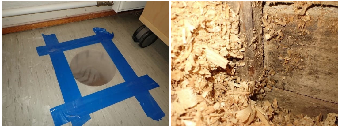
Kuvat 138 ja 139. Kirjastosalin 102 välipohjan avaus R25. Muottilauodoissa todettiin mustumista ja avauksessa aistittiin mikrobiperäistä hajua ja öljyn hajua.
