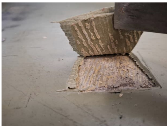
Kuva 58. Poikien pukuhuoneen viiltomittaus MP7. Mittapisteessä MP7 kosteus oli koholla muovimaton alla. Viillosta havaittiin tulevan lievää kemiallista hajua.
