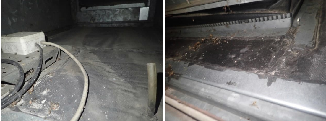
Kuvat 383 ja 384. Ilmanvaihtokoneen äänieristeet ja äänenvaimentimien materiaalit on uusittu pinnoitettuihin. Koneessa ei ole kuitulähteitä. Pinnoilla on paljon epäpuhtauksia.
