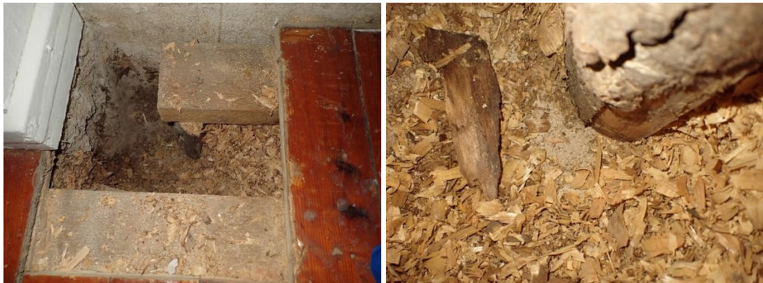
Kuvat 66 ja 67. Konesalin lattian avaus R4. Kutterinlastueristeen todettiin tummuneen kummassakin konesalin lattian avauksessa.
