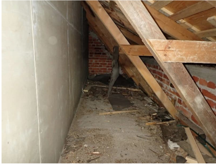
Kuva 353. A-osan sivuvintin länsipuolen tilan 216 perällä oli runsaasti rakennusjätettä.
