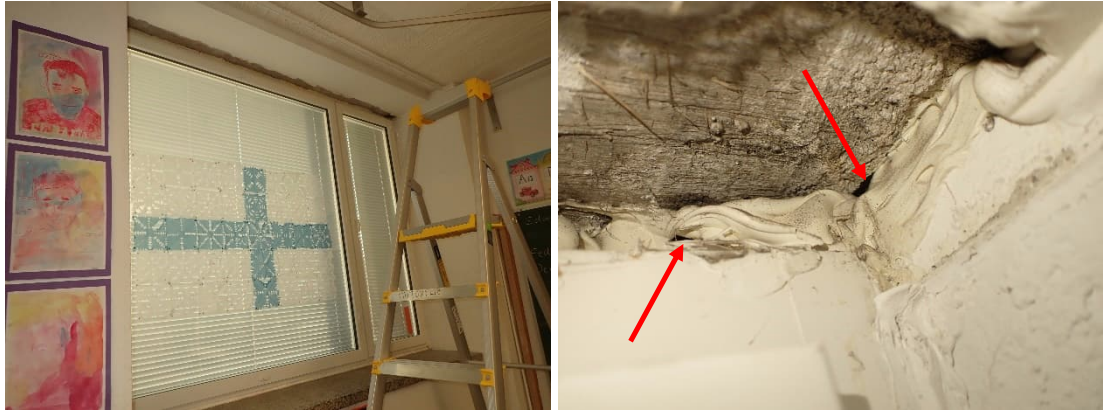
Kuvat 249 ja 250. VALMO-luokan uusitun ikkunan listoituksia avattiin, avaus R8. Tilkerako oli massattu ja massauksessa havaittiin paikallisia epätiiveyskohtia (nuolet).
