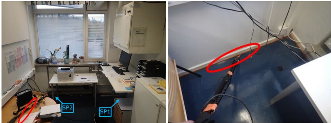
Kuvat 176 ja 177. Opetustilan välipohjan (lattia) merkkiainekokeen havaittu vuotopaikka on merkitty punaisella ympyrällä. Kaasun syöttöpisteet on merkitty sinisillä nuolilla.
