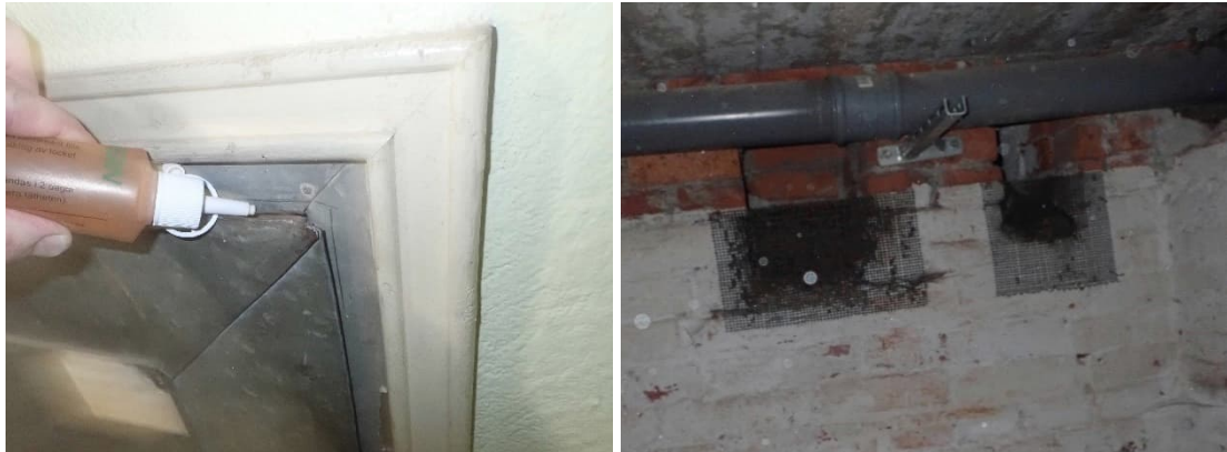
Kuvat 421 ja 422. Putkikanaalin luukun kautta virtasi ilmaa kellaritilojen suuntaan. Entisen asunnon alla olevaan kellarisiin virtasi runsaasti ilmaa sulkemattomien, verkolla peitettyjen hormien tai putkikanaalin johtavien aukkojen kautta.
