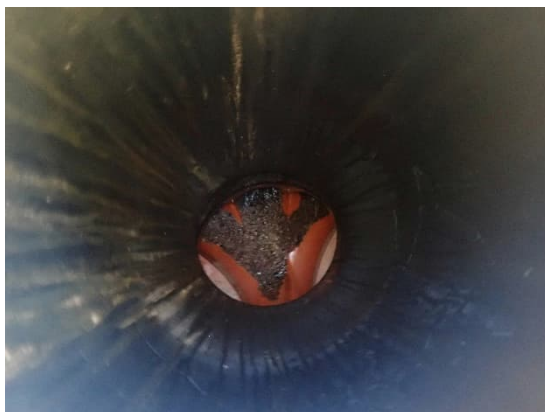
Kuva 16. C-osan kaakkoiskulman tarkastuskaivossa oli hiekkaa.
