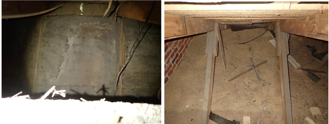
Kuva 349 ja 350. Matalan katon alla oli kastunutta tervapaperia ja purua. Kuvat on otettu korkeamman vintin puolelta.
