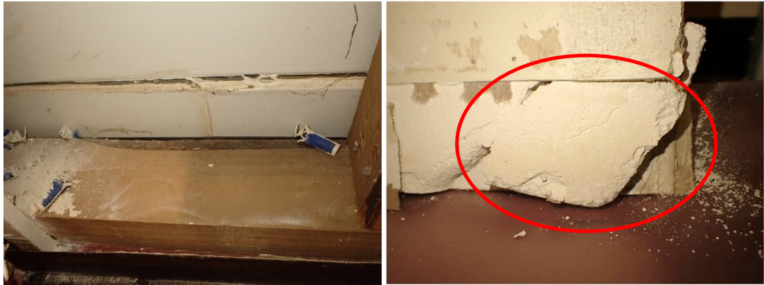
Kuvat 295 ja 296. Keittiön kuiva-ainevaraston kylmiötä vasten olevan väliseinän avaus R11. Kipsilevyn alaosassa havaittiin hieman kellastumaa, mutta levyssä ei todettu mikrobikasvustoa.
