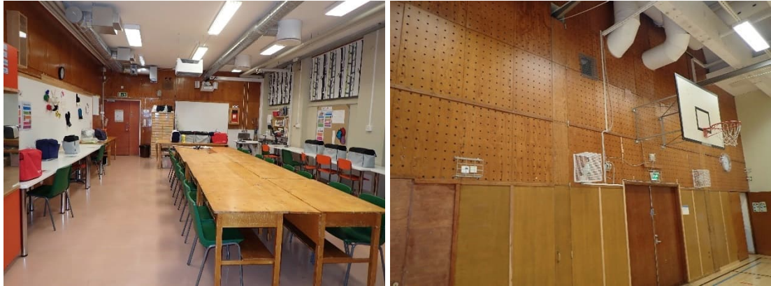
Kuvat 273 ja 274. Tekstiilityönluokan ja liikuntasalin viilupintaista levyä kiviaineisen seinän pinnassa. Liikuntasalin levyn takana oli mineraalivillaa.
