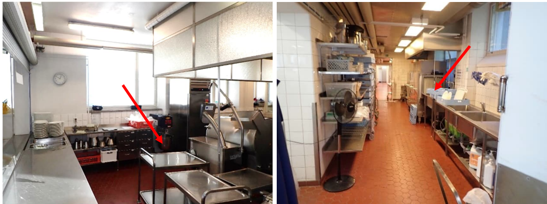
Kuvat 226 ja 227. Keittiön ulkoseinissä / maanvastaisissa ulkoseinissä todettiin vain paikallisesti kosteutta etupihan puolella ja takapihan tiskipisteen kohdalla.
