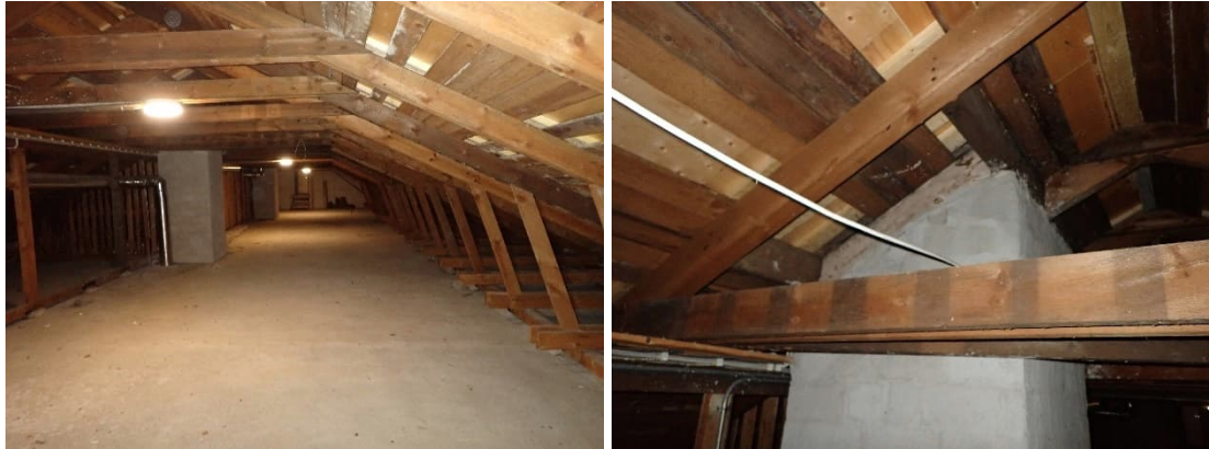
Kuva 344 ja 345. A-osan isoa vinttitilaa ja vanhoja kosteusjälkiä hormin päällä.
