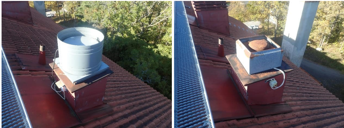
Kuvat 401 ja 402. Vuonna 2007 uusittu huippuimuri ja tätä selvästi vanhempi huippuimuri.
