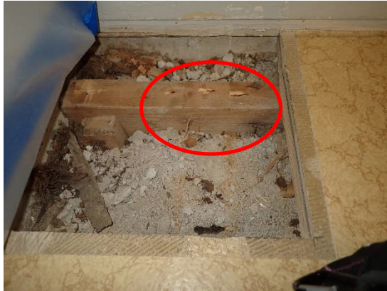
Kuva 147. Entisen asunnon lattian avaus R17 ulkoseinän vierellä. Puurungossa havaittiin hieman kosteusjälkiä (ympyrä).
