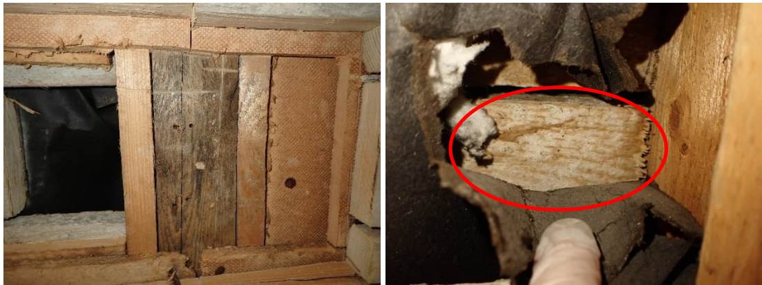
Kuva 373 ja 374. Luokan 218 yläpohjan avaus R43. Yläpohjasta puuttui palkin vierestä paikallisesti eristeet, tervapaperi oli epätiivis ja eristetilän takana olevassa laudassa oli kosteusjälkiä (ympyrä).
