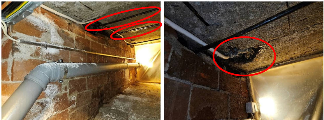
Kuvat 92 ja 93. Keittiön alla kulkevan putkikanaalin sivuhaaran kosteusjälkiä. Punaisella korostettu katon alueita, joista tippui vesipisaroita.
