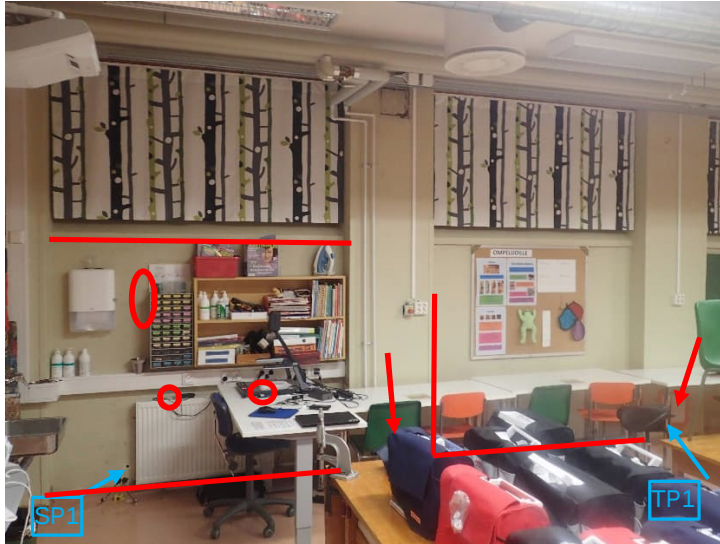
Kuva 255. Tekstiilityön luokan maanvastaisen seinän merkkiainekokeen MA7 havaitut ilmavuotopaikat. Punaisilla ympyröillä on esitetty merkittävät pistemäiset vuotokohdat ja seinän halkeamat, nuolilla läpivienti, pistorasia ja avauskohta ja yhtenäisellä viivalla jatkuvat vuotokohdat.
