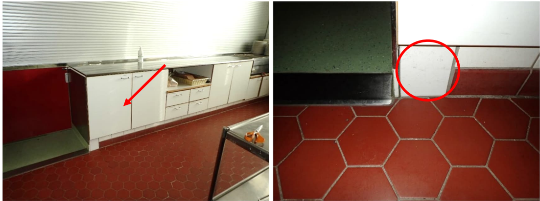
Kuvat 287 ja 288. Keittiön kaapisto, jossa todettiin mikrobiperäistä hajua ja jonka alla todettiin paikallisesti koholla olevia pintakosteusilmaisimen arvoja (ympyrä).
