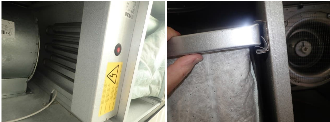
Kuvat 395 ja 396. Tuloilmaa lämmitetään tarvittaessa sähkövastuksella. Suodattimien kehykset olivat melko tiiviitä.
