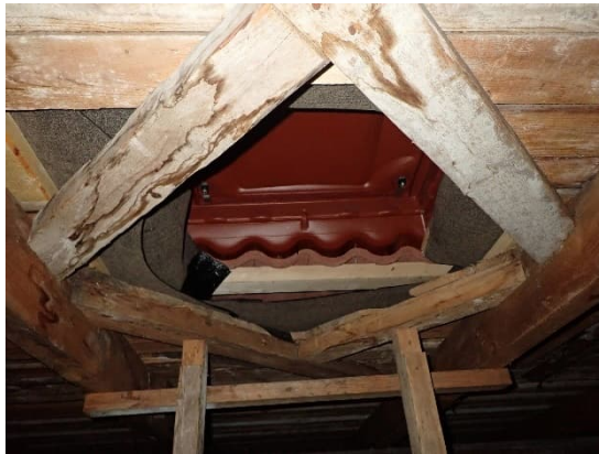
Kuva 346. A-osan ison vinttitilan kattoluukku ja epätiivis kermi.
