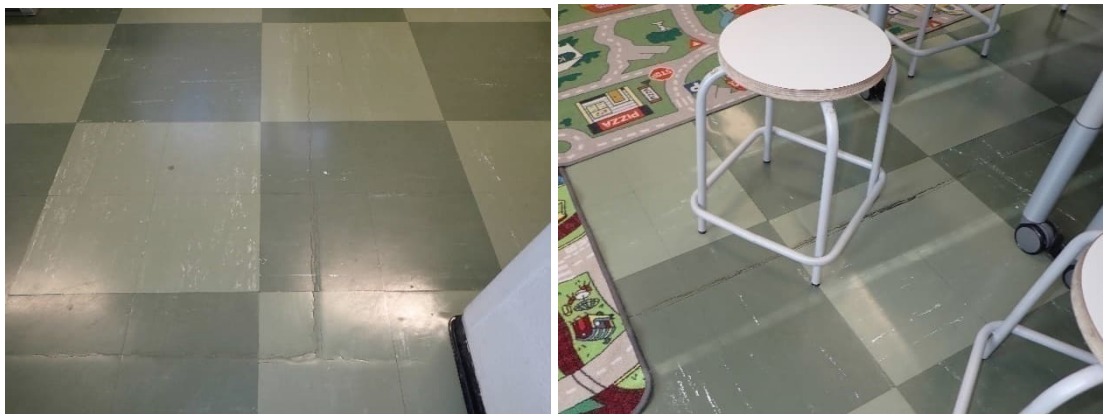
Kuvat 35 ja 36. Ruokalan ja sinne jälkikäteen rakennetun iltapäiväkerhon tilojen lattioissa on vinyylilaattaa, joka sisältää asbestia. Laatoissa havaittiin joitain halkeamia.
