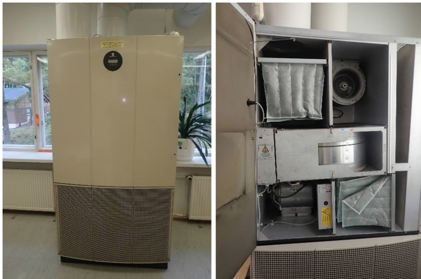
Kuvat 393 ja 394. Luokkakohtaiset ilmanvaihdonkoneet ovat PM-Luften valmistamia ja ne ovat vuodelta 2003. Tuloilma tuodaan syrjäyttävästi koneen alareunan ritilän kautta ja poistoilma imetään koneen päältä.
