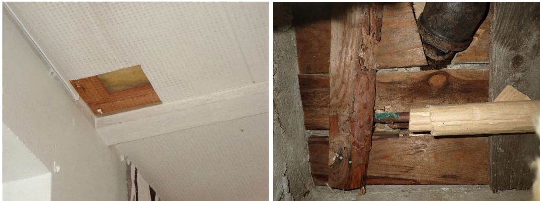
Kuvat 158 ja 159. Käytävän 119 alakaton avaus R23. Kohdassa oli vanhoja vuotojälkiä kupariputkissa, mikrobikasvuun viittaavaa tummumista muottilautoissa ja mahdollisesti asbestia sisältäviä putkieristeitä.
