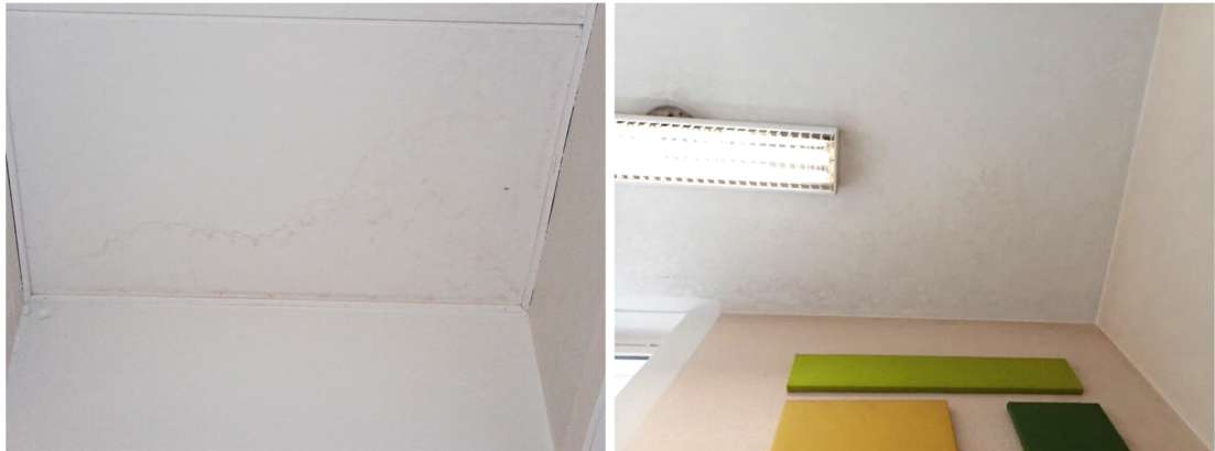
Kuvat 364 ja 365. B-osan kolmannen kerroksen sisäkatoissa ja porrashuoneen 308 ylätasanteen betonirakenteisen katon pinnassa havaittiin kosteusjälkiä.
