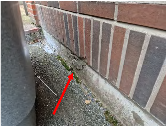
Kuva 16. Sokkelissa on paikoin rapautumisvaurioita.
