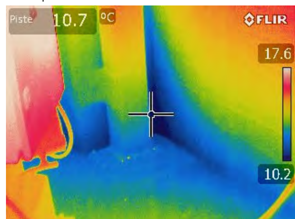
Kuva 93. Edellisen kuvan ulkonurkan alueen muuta ulkoseinäaluetta viileämpi alue.
