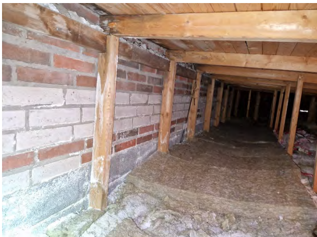
Kuva 187. Puurakenteiden kosteusvaurioita. Lämmöneristeitä on uusittu/uudelleen asennettu paikoilleen seinän vierellä.
