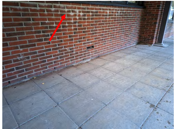
Kuva 39. Ikkunoiden alapuolisen julkisivumuurauksen pinnalla on kalkkihärmettä katoksen kohdalla.
