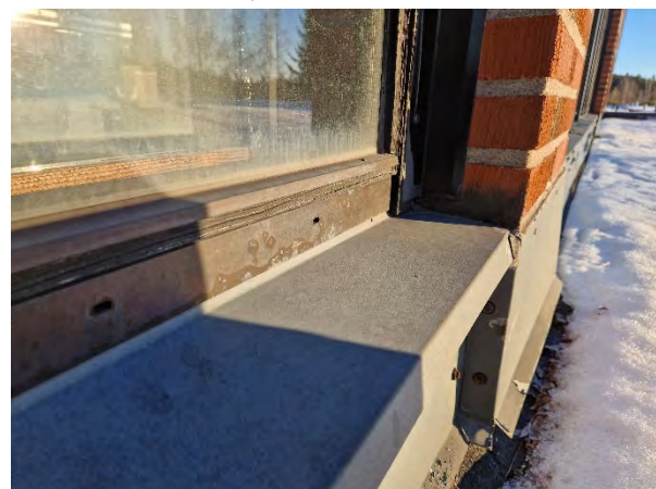
Kuva 49. Laajennusosan ikkunan vesipellin kaato on olematon.
