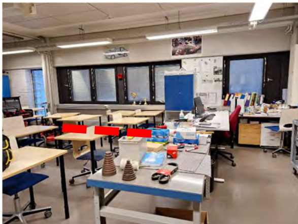
Kuva 108. Tilassa B031 ulkoseinän ja lattian liitos on sepätiivis.
