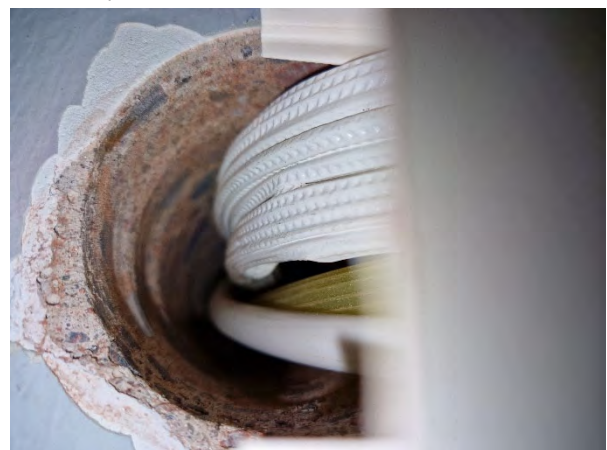
Kuva 55. Täysin avoin lämpöpumpun läpivienti tilassa B033.
