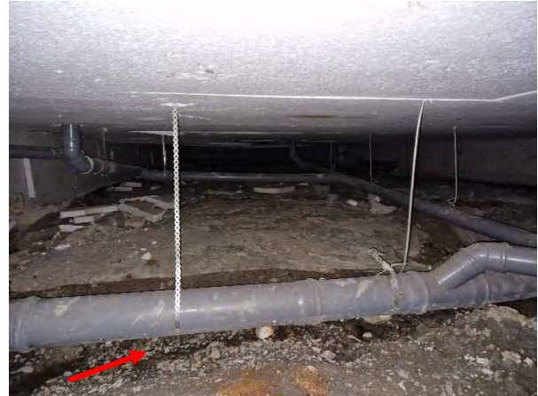
Kuva 11. Korjaamotilan alustatilassa on virrannut vettä jätteen suurempaa kiviainesta näkyviin.
