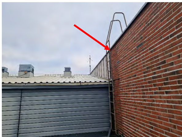
Kuva 141. Räystään pellitys ohjaa vettä julkisivupintaan ilmanvaihtokonehuoneen vierellä.
