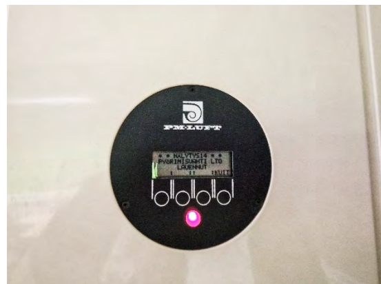
Kuva 251. Tilan B2017 iv-kone vikailmoitustilassa.
