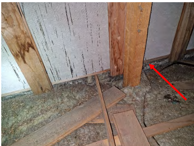
Kuva 192. Ulkoseinän alaosan lämmöneristeissä on tummentumia.
