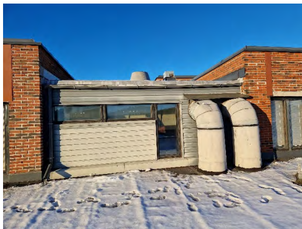
Kuva 143. Käytävän 011 vesivahingon kohdalle ohjautuu vettä pulpettikatolta.
