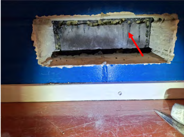
Kuva 59. Rakenneavaus US1. Kermin sisäpinnalla on asennusajaisia bitumin valumia.
