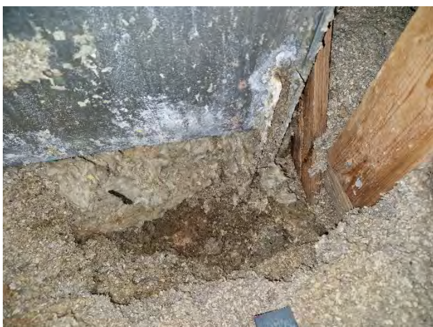
Kuva 212. Läpivientihormin vierellä oleva puhallusvilla on märkää ja puurakenteissa on kosteutta.
