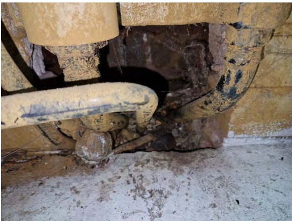
Kuva 52. Työsaleissa on useita rakenteisiin avoimia läpivientejä.
