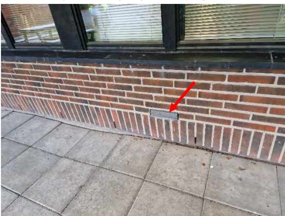
Kuva 42. Julkisivumuuraus on maantasalla katoksen kohdalla. Seinässä on alapohjan korvausilmäsäleikkö.
