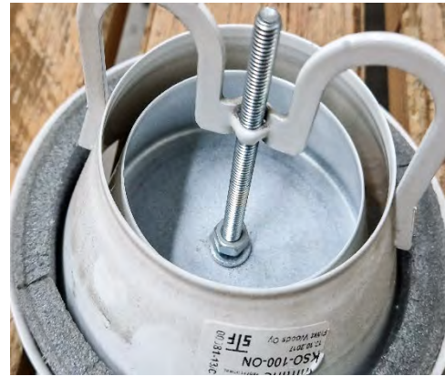
Kuva 253. Poistopäätelaitteen säätö lukitsematta.
