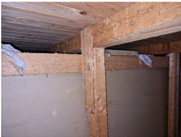
Kuva 173. Yläpohjatilaa on osastoitu kipsilevyillä, Osastoinneissa on paikoin suuria aukkoja tuuletuksen vuoksi.
