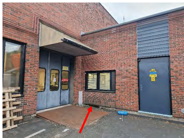
Kuva 37. Paikallinen jatkuva kosteusrasitus on mahdollistanut muutamin paikoin sammalkasvustoa pinnoille.
