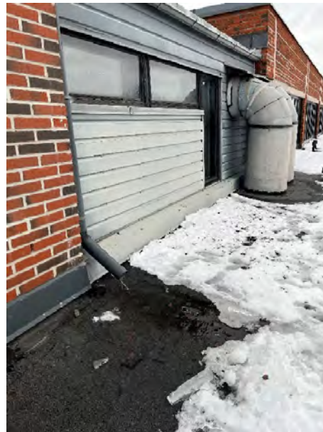
Kuva 169. Käytävän 011 vuotokohta vesikatolla.
