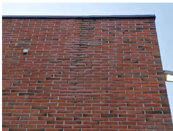
Kuva 233. Sadeveden aiheittavaa kosteusrasitusta julkisivurakenteessa. Räystäään liittymäpellitykset ovat epäviitit ja valuttaa vedet julkisivurakenteisiin.
