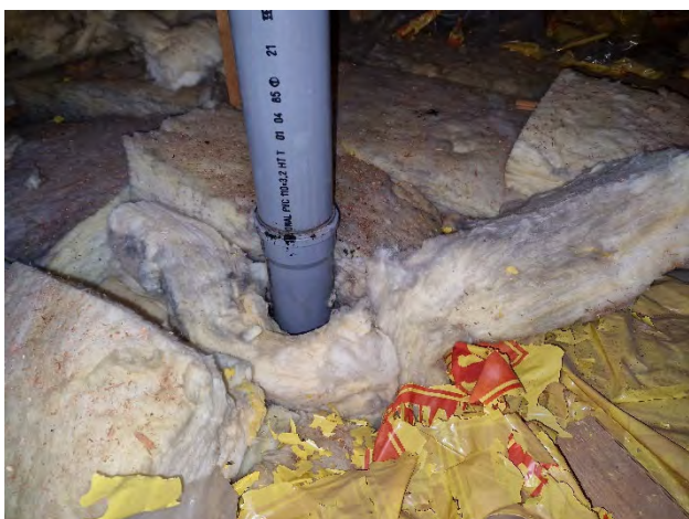
Kuva 203. Tuuletusviemäri on lämmöneristämätön.
