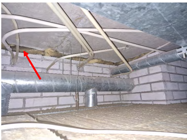
Kuva 162. Alkuperäisen osan alakattotilan kohdalla olevien väliseinien yläosien villoissa on ilmavirtausten aiheuttamia tummentumia.
