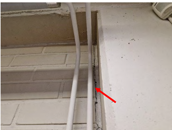
Kuva 54. Sisäpuolen tiilimuurauksen ja betonipilarin välistä rakoa.
