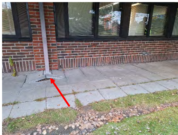
Kuva 229. Maanpinnan painumista rakennuksen vierustalla.
