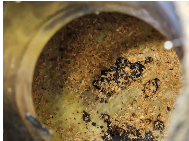
Kuva 153. Korjaamohallin yläpuolella olevan alipainetuuletusputken kohdalla on sahanpurua levyvillaeristeen päällä. Tuuletusväli on noin 100 mm korkea.
