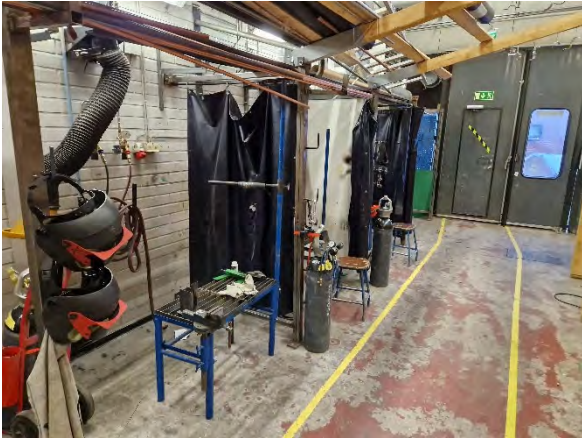
Kuva 116. Osassa työsaleista maalipinnoitteet ovat kuluneita.
