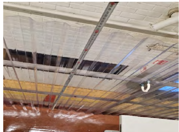
Kuva 131. Työsalin B097 parvelle olevaa kaidetta on korotettu vain yläreunastaan kiinitetyllä valokatelevyllä.
