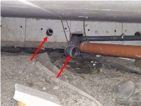
Kuva 10. Luokkatilan B026 alapuolella olevan sadevesiviemärin liitos on auennut. Palkin avoin läpivienti-/tuuletusaukko.
