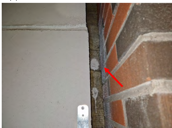
Kuva 58. Tilan B1008 kohdalla olevan entisen ulkoseinän pinnalla on kalkkihärmettä.
