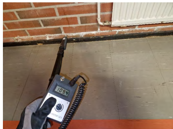
Kuva 121. Käytävän B009 ja viereisen pesuhuonetilan väliseinässä on kohonneita pintakosteusarvoja ja kalkkihärmettä.
