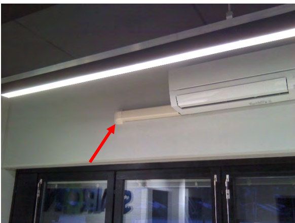
Kuva 98. Luokkatilan B033 ilmalämpöpumpun läpivienti on täysin tiivistämättä.
