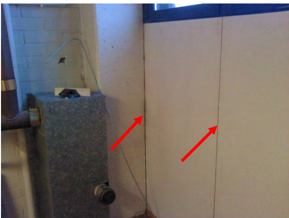
Kuva 104. Tilan B100 parvella olevan ulkoseinän levyrakenteisen sisäverhouslevyn saumat ovat tiivistämättömiä.
