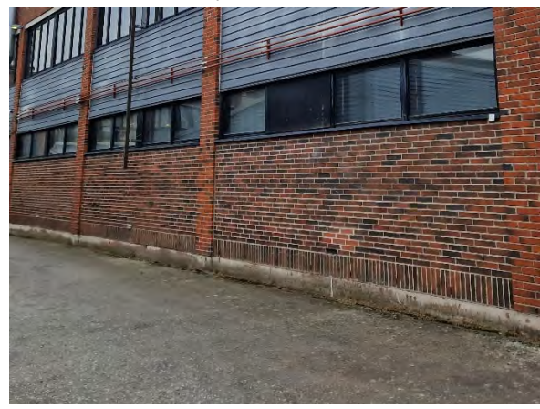
Kuva 15. Sokkelissa on kosteuden aiheuttamaa tummuutta.
