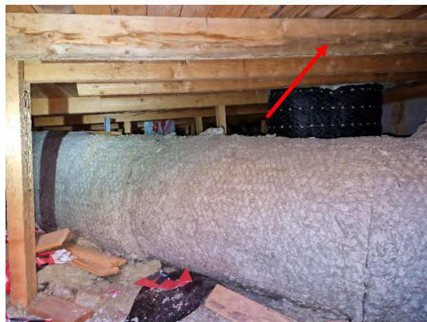
Kuva 193. Puurakenteissa on kosteusjälkiä.
