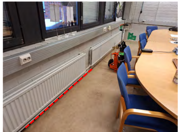
Kuva 109. Tilassa B081 ulkoseinän ja lattian liitos on epätiivis.
