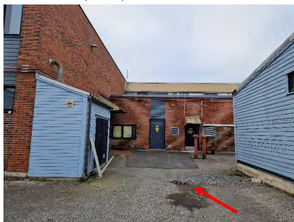
Kuva 231. Sadevesikaivon ympärille kerääntynyt soraa.
