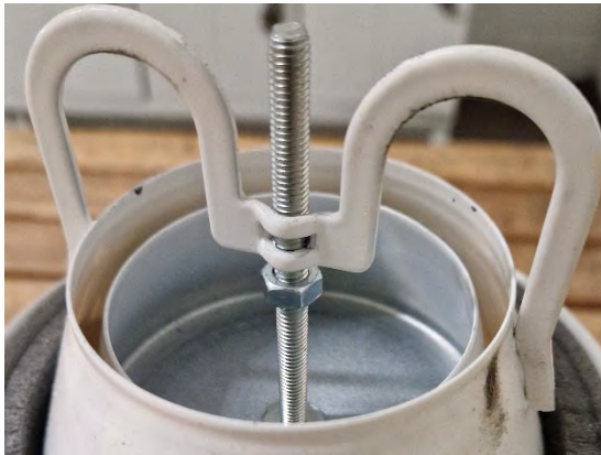
Kuva 252. Poistopäätelaitteen säätö lukitsematta.
