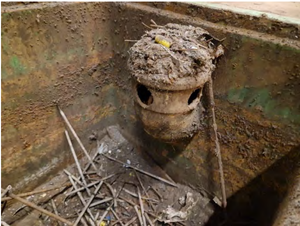
Kuva 18. Työsaleissa olevissa lattiakaivoissa ei ole vettä, jolloin viemäriputkesta on mahdollista päästä hajua. Tutkimushetkellä ei kuitenkaan havaittu viemärinhajua tarkastettujen kaivojen osalta.
