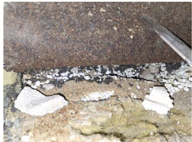
Kuva 135. US9, tuuletusväli havaittavissa ainoastaan pystykoolauksen kohdalla.
