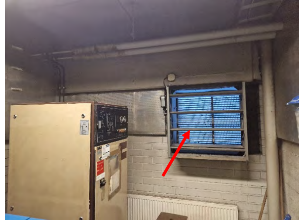
Kuva 129. Kompressorihuoneessa on avoin säleikkö ja koneellinen poistopuhallin lämpötilan hallinnan vuoksi.
