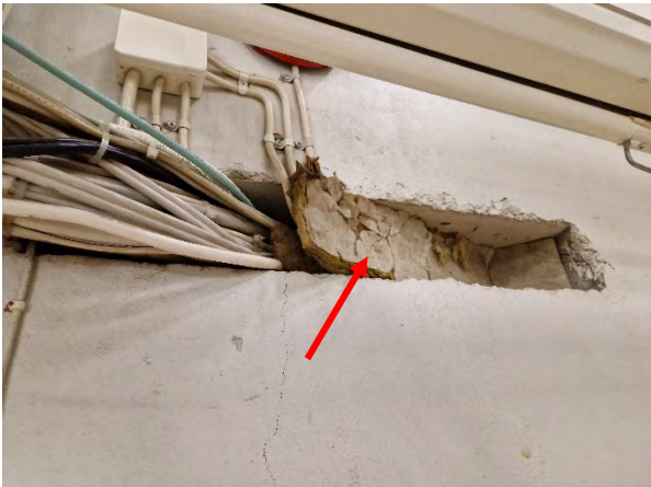
Kuva 124. Työsalin B099 ja käytän alakattotilan välillä oleva läpivienni on suljettu osin mineraalivillaisella akustiikkalevyllä. Läpiviennistä havaittiin ilmavirtaus työsalin päin.
