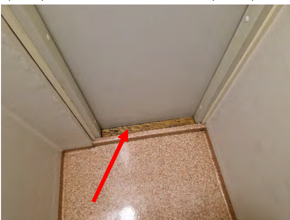
Kuva 126. Suihkutilan B1032 roiskevesi kertyy osin kynnyksen päälle, missä on jo tummentumaa.
