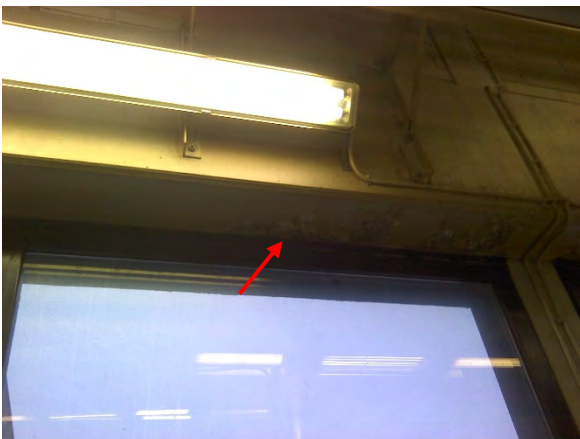
Kuva 90. Työsalin B162 ikkunan alapuolella on kosteusjälkeä/pinnoitevaurioita.
