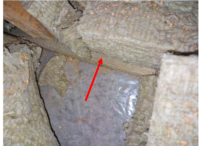
Kuva 183. Ontelolaattaa vasten oleva vaakapuu on painekylästettyä puuta.
