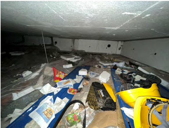
Kuva 6. Alustilassa on paikoin runsaasti erilaista jätettä.
