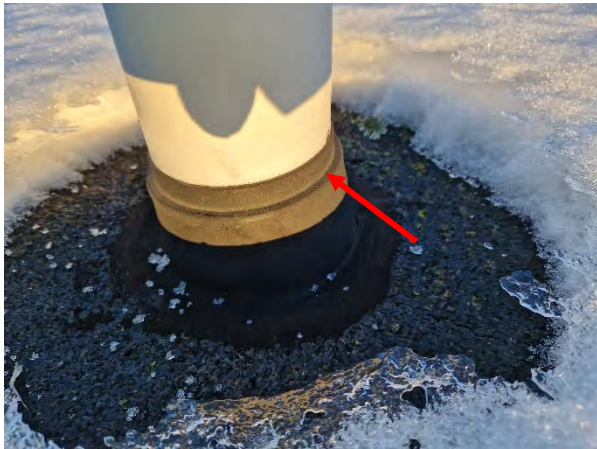
Kuva 152. Viemärin tuuletusputken läpivientikumista puuttuu teräksinen kiristyspanta korjaamohallin kohdalla.
