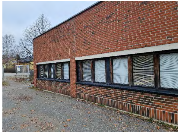
Kuva 35. Laajennusosan julkisivumuuraus on matalimmillaan noin 100 mm maanpinnasta.
