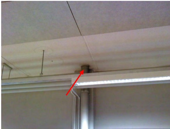
Kuva 219. Huonetiloissa olevien tuuletusviemäreiden kohdalla on kylmempiä kohtia.
