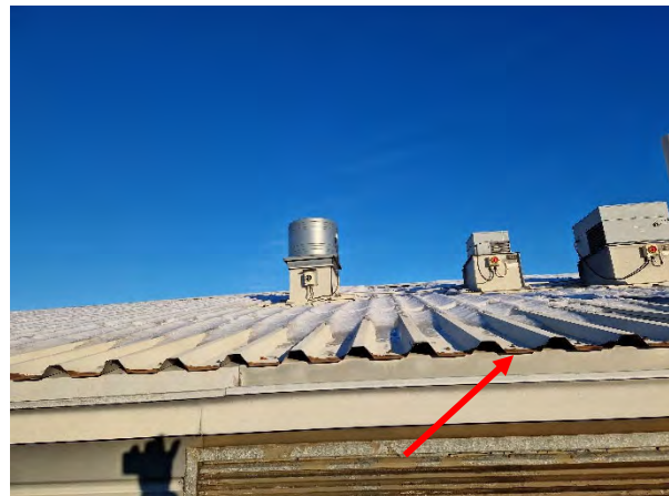
Kuva 155. Ilmanvaihtokonehuoneen vesikattopellin alareunassa on pinnoitevaurioita.
