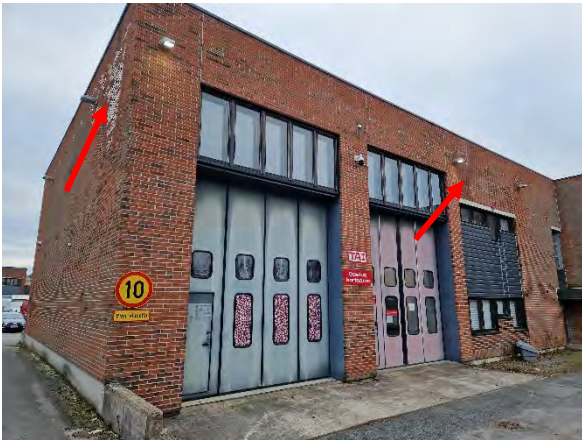
Kuva 38. Räkyläpeltityksiltä ohjautuu vettä julkisivupinnoille.
