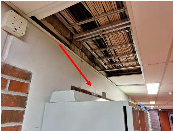
Kuva 168. Seinustalla valuu vettä yläpuolisista rakeinteista.
