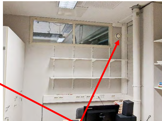
Kuva 249. Tilan B2018 poistoilma ohjattu viereisen tilan B2017 iv-koneeseen.
