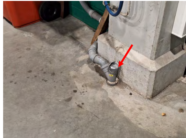
Kuva 17. Korjaamotilan B1002 viemärin haara on tiivistetty teippaamalla.
