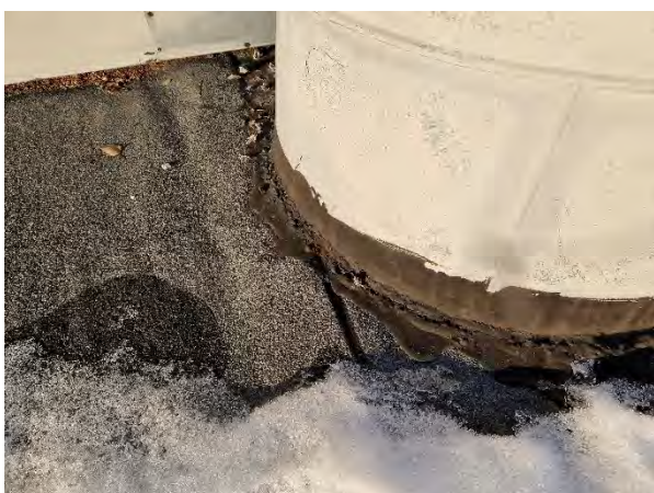
Kuva 144. Ilmanvaihtokanavien läpivientä on tiivistetty bitumilla.
