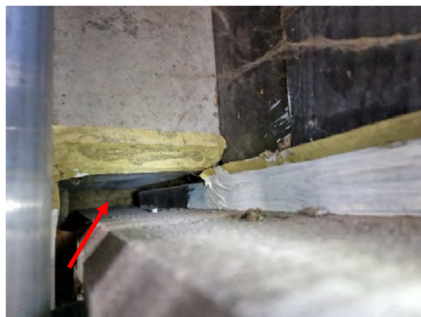
Kuva 57. Laajennusosan pilareiden liitoskohdat ovat täysin avoimia ja näkyvissä on lämmöneristeitä.
