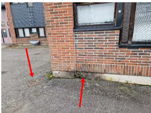
Kuva 232. Sokkelin kosteusrasitusta roiskevedestä sekä salaojan tarkastuskaivo.
