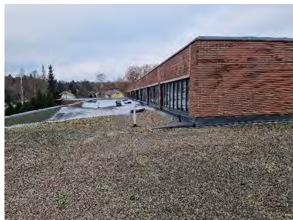
Kuva 139. Vesikatolla on osin paksu singelikerros.
