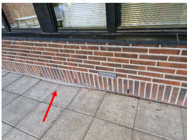
Kuva 230. Maanpinnan painumista rakennuksen vierustalla.
