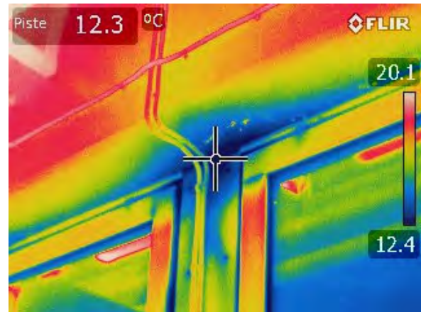
Kuva 95. Edellisen kuvan levykoteloinnin kohdalla olevaa ilmavuotoa.
