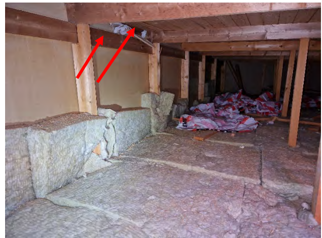
Kuva 196. Seinän vierellä olevissa puurakenteissa on hieman tummentumaa. Osastoinnin kipsilevyssä on reikä.
