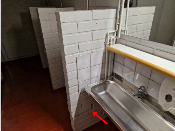
Kuva 128. Pukuhuonetilan B065 pisuaarien väliseinä on osin pois paikoiltaan.
