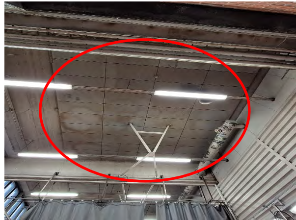
Kuva 159. Työsalin katossa on vuotojälkiä laajalla alueella.
