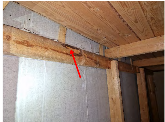
Kuva 172. Seinän vierellä olevissa puurakenteissa on kosteusjälkiä.
