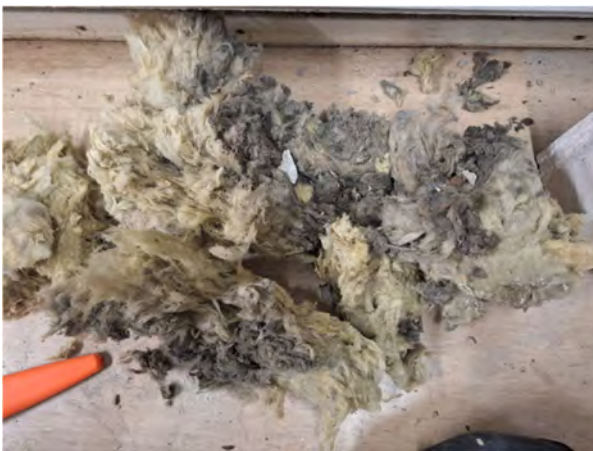
Kuva 78. US9, julkisivutiilen vastainen villa selkeästi tummentunut.
