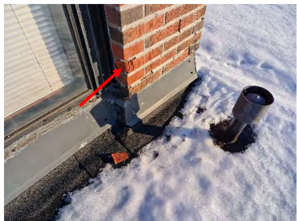
Kuva 43. Tiilen pakkasrapautumaa vesikaton tasoeron ulkoseinässä.
