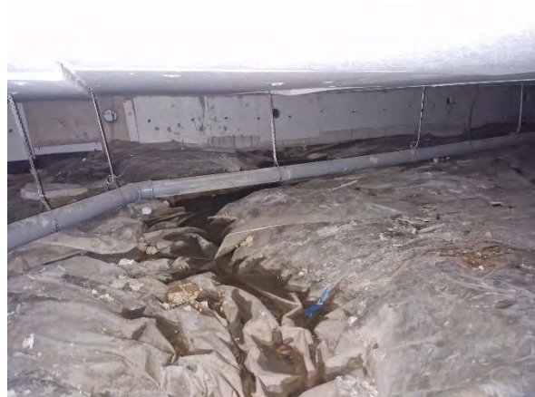
Kuva 9. Alustilassa on paikoin seisovaa vettä muovipeitteen päällä
