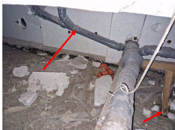
Kuva 7. Alustilassa on puutteellisesti kannakoituja putkia ja lahoamistilassa olevaa puutavaraa..
