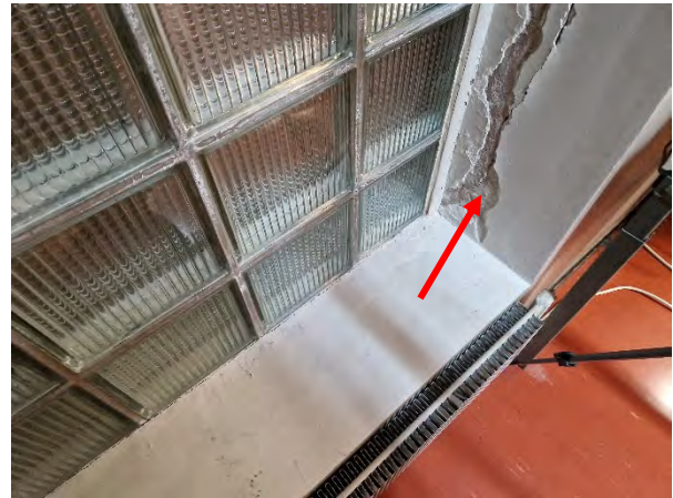
Kuva 51. Luokkatilan B025 ikkunanpielien pinnoitevaurioita.
