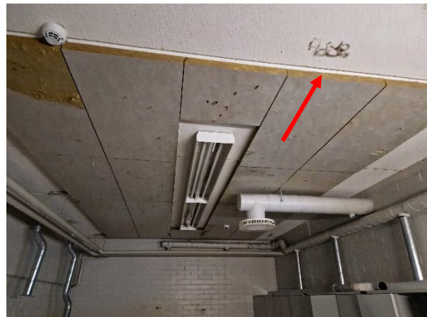
Kuva 161. Pukuhuonetilan akustiikkalevyjä on rikottu, Levyissä on avoin mineraalivillareuna.
