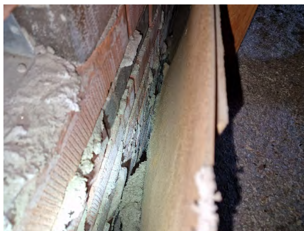
Kuva 213. Julkisivumuurauksen ja kovalevyn välisessä tuuletusraossa on osin puhallusvillaa ja hieman laastipurseita.
