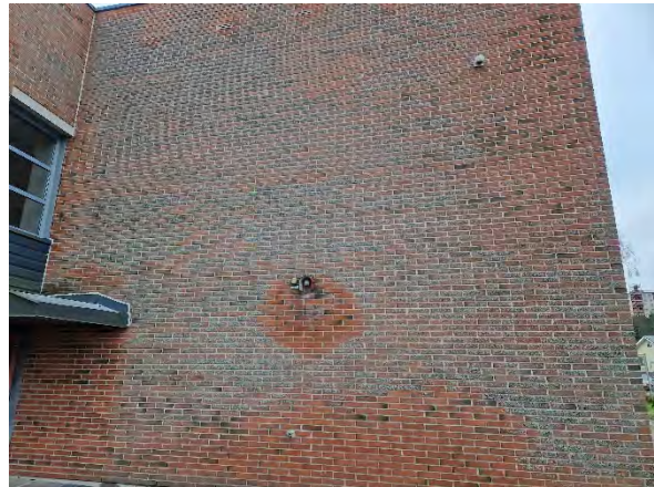
Kuva 33. Julkisivun tiilipinnassa on paikoin runsaasti jäkälä-kasvustoa.
