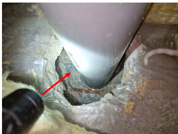
Kuva 204. Tiivistämätön läpivienti ontelolaatan kohdalla.
