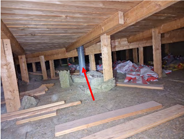
Kuva 182. Tuuletusviemäri on lämmöneristämätön.
