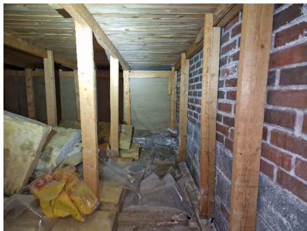
Kuva 176. Kuivatuksen vuoksi purettuja lämmöneristeitä ulkoseinän tasoon vierellä.
