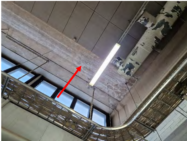
Kuva 158. Korjaamotilan B074 yläpohjan vuotojälkeä ulkovoien läheisyydessä.
