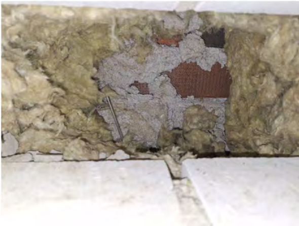
Kuva 72. US5, julkisivumuurauksessa on reilusti laastipurseita.
