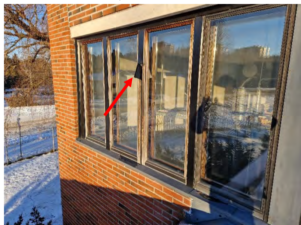
Kuva 48. Laajennusosan ikkunan pellitys on repeytynyt.
