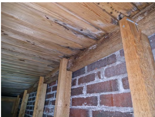
Kuva 177. Vuotoalueen puurakenteiden vaurioita.
