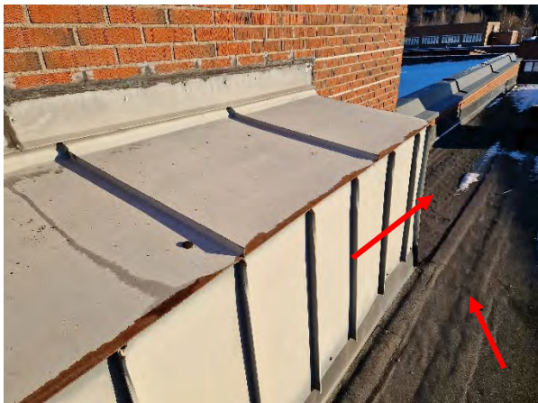
Kuva 154. Kermien painumaa kermien saumojen muotoon ja pistemäistä painumaa työsaliin välisellä osuudella.
