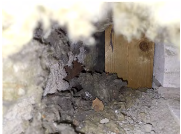
Kuva 79. US9, tuuletusrako havaittavissa ainoastaan pystykoolauksen kohdalla.
