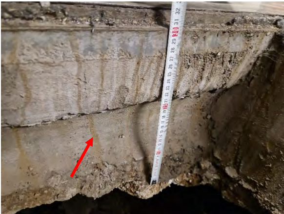
Kuva 8. Alapohjan ontelolaatan vahvuus on 265 mm. Ontelolaatan päällä on n. 50-80 mm pintavalu. Aukon reunalla on ilmeisesti luukun sauman kautta päässeiden siivousvesien aiheuttamia valumajälkiä.
