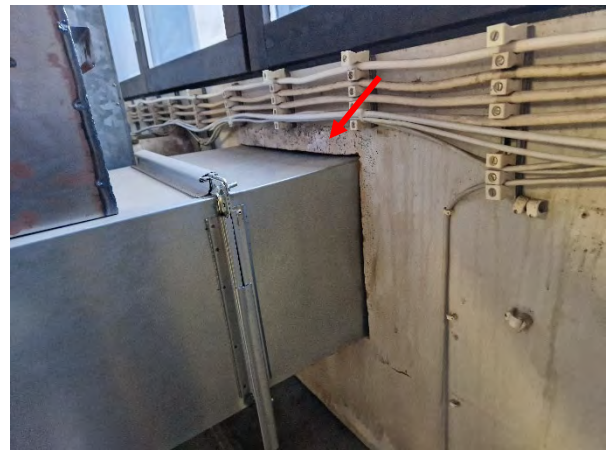
Kuva 53. Tiivistämättömän läpiviennin ympärille on muodostunut pinnoitevaurioita.
