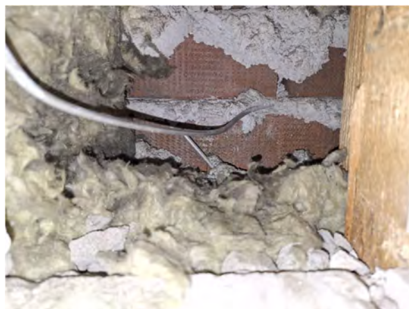
Kuva 64. US1, julkisivutiilissä on reilut laastipurseet taustapinnalla.
