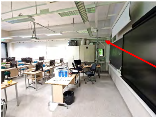
Kuva 248. Luokkahuoneen B2017 tilakohtainen iv-kone.
