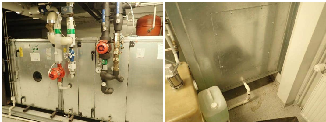
Kuvat 575 ja 576. Yleiskuvat ilmanvaihtokoneesta. Ulkoilmakammio on varustettu viemäröinnillä, mutta lattialla oli vanhoja kosteusjälkiä.
