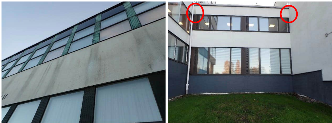
Kuvat 278 ja 279. A-osan luoteissivulla oli valumajälkiä kuparilevyjen alla ja räystäiden nurkissa (soi-kiot).
