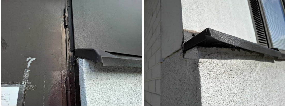
Kuvat 295 ja 296. Ikkunoiden alareunojen vesipeltien paikallisia puutteita A-osan välituntipihan puoleisella seinustalla.
