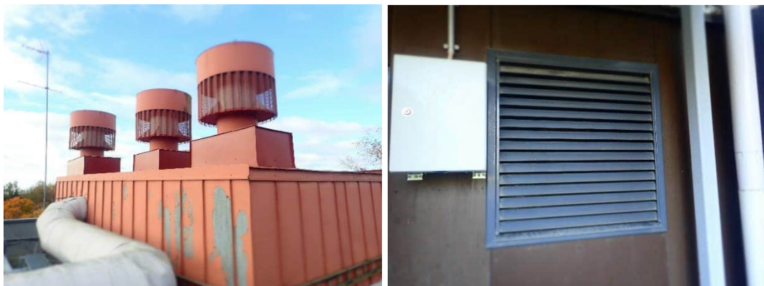
Kuvat 685 ja 686. Yleiskuvat kattoasenteisista ilmaottolaitteista (tuloilmakoneet TK3, TK4 ja TK5) ja seinäasenteisesta ulkoilmasäleiköstä (ilmavaihtokone TK12).
