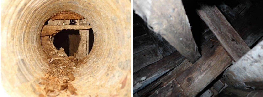
Kuvat 458 ja 459. Musiikkiluokan A043 portaan alla oli mustuneita ja lahonneita muottilautoja, avaus R15.
