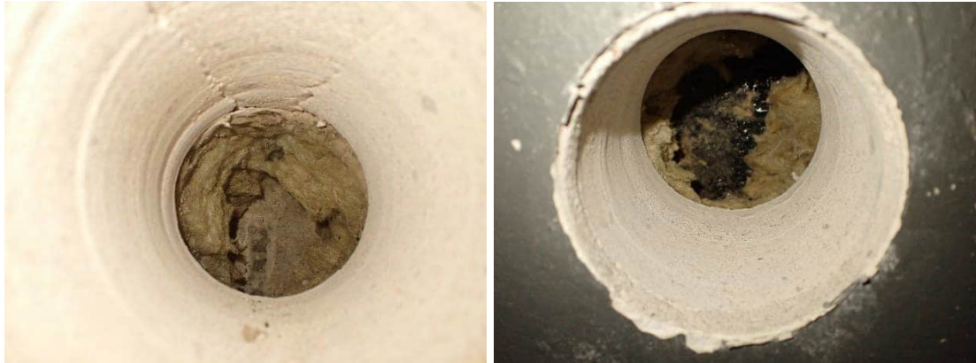
Kuvat 334 ja 335. Musiikkiluokan avauksessa R14 ei ollut pikisivelyä, muissa avauksissa sively todettiin. Oikeanpuoleinen kuva on porrashuoneen B010 avauksesta R17.
