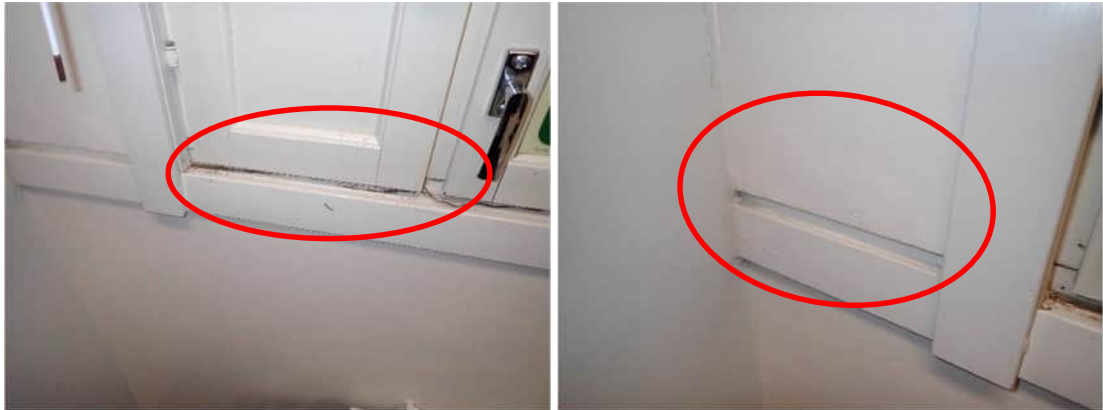
Kuvat 311 ja 312. Kosteusjälkiä tuuletusikkunan alla olevassa listoituksessa ja ikkunan viereisessä levyrakenteessa luokassa A104.
