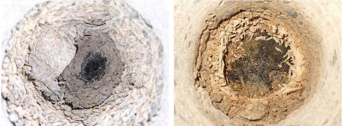
Kuvat 111 ja 112. Kuvat varaston A110 avauksesta R37 ja luokan B012 avauksesta R26. Avauksen R26 läheisyydessä havaittiin mikrobiperäistä hajua.
