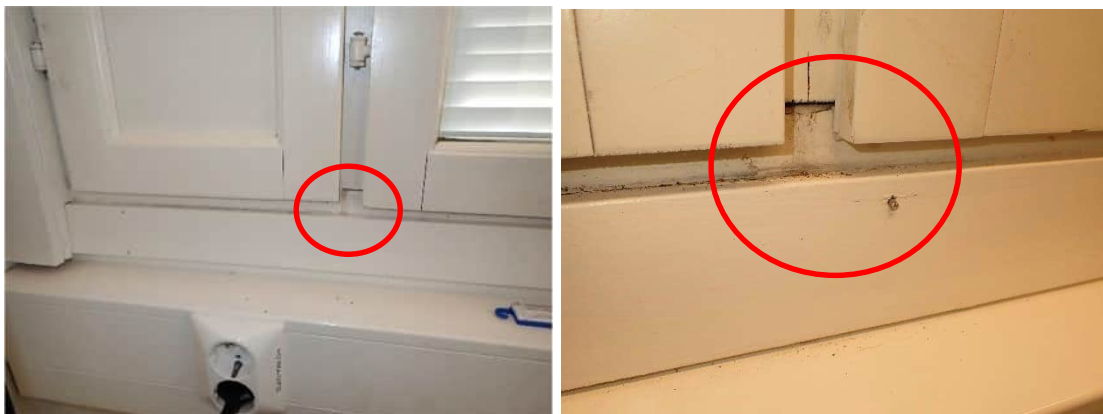
Kuvat 313 ja 314. Tilojen A109 ja A111 ikkunoiden välikarmien liitoksissa oli jälkiä veden valumisesta.
