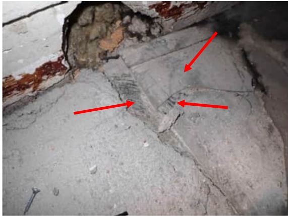
Kuva 135. Luokan B012 väliseinän levytyksen takana oli lattiapinnassa vanhaa harmaata vinyylilaattaa ja mustaa liimaa, jotka kumpikin sisältävät asbestia.
