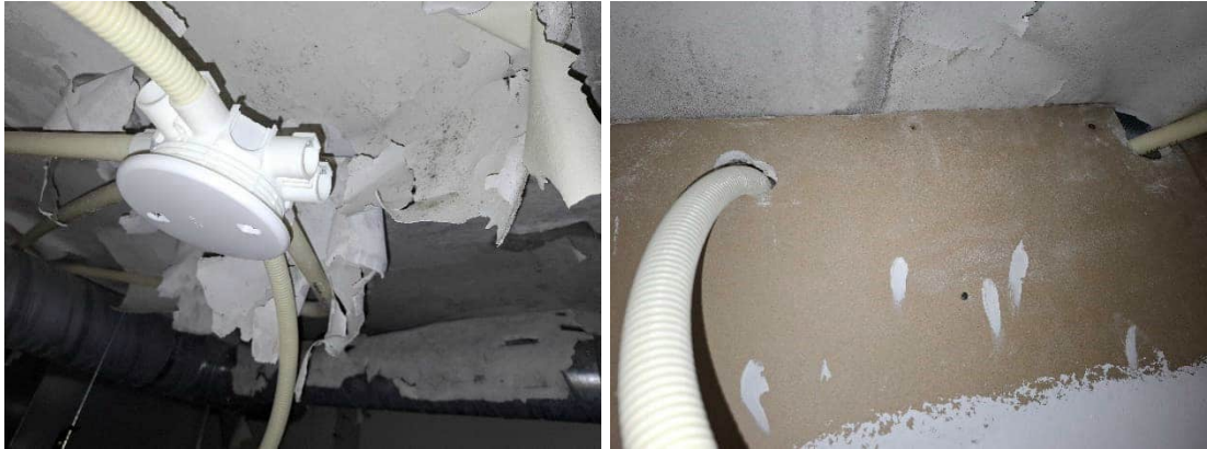
Kuvat 224 ja 225. Pukuhuoneen C007 alakaton avaus R82. Välipohjan tasoite ja maali oli irronnut lähes kauttaaltaan, ja siinä oli mikrobikasvua. Sähkökeskuksen väliseinässä kipsilevyn yläpäässä havaittiin tummumaa.
