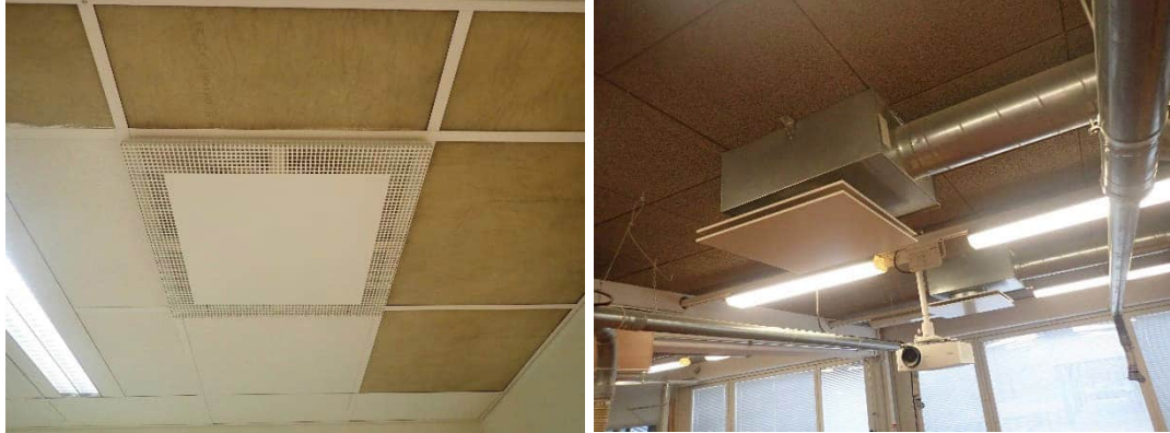
Kuvat 687 ja 688. Yleiskuvat tuloilmahajottajista. Vasemman kuvan päätelaite on B-osan tilasta B012 ja oikean kuvan päätelaite on D-osan tilasta D135. Tuloilmahajottajien tasauslaatikoiden äänenvaimennusmateriaalit olivat tarkasteluiden perusteella polyesterilevyjä tai kangaspäällysteisiä mineraalivillalevyjä.
