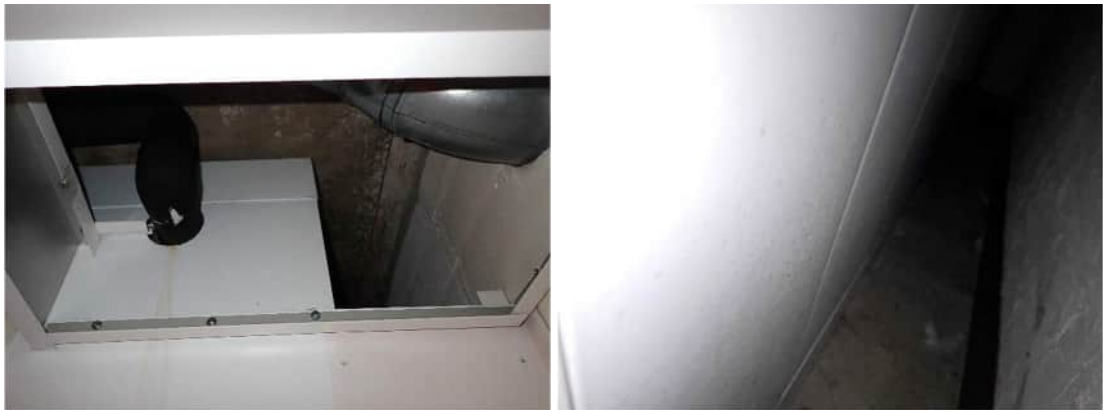
Kuvat 441 ja 442. Keittiön C001 kylmiön edustan avaus R59. Kylmiön väliseinän läpiviienti oli epätiivis ja kohdassa oli valumajälkiä. Kylmiön seinäpinnassa havaittiin mikrobikasvuun viittaavaa pilkkua.
