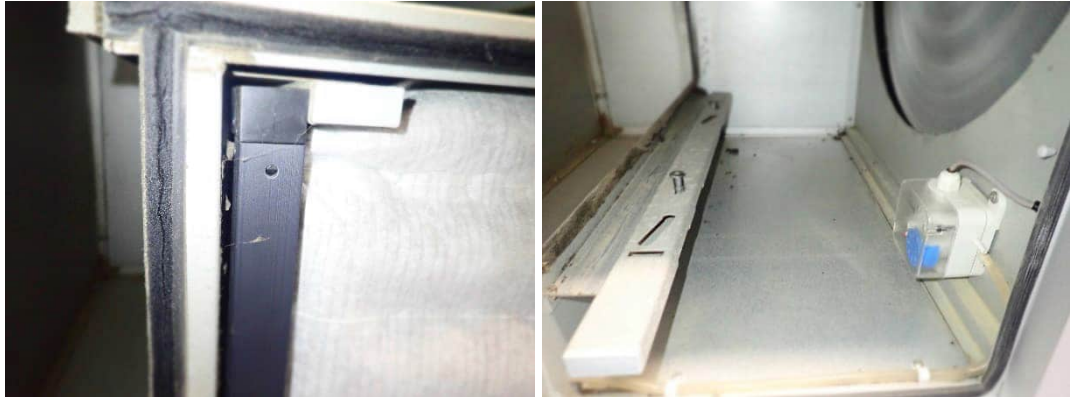
Kuvat 670 ja 671. Yleiskuvat tuloilmakoneen tuloilmasuodattimen liittymästä ja suodatinosasta. Suodatin ei tiivistynyt täysin ja suodatinosan pohjalla oli hieman mustaa roskaa mahdollisesti haurastunutta tiivistenauhaa.
