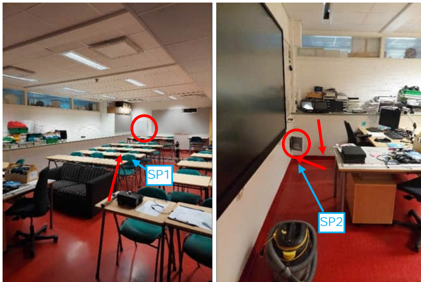
Kuva 157 ja 158. Luokkahuoneen B012 merkkiainekokeessa MA7 havaitut ilmapuotopaikat ennen muovimaton ylösnoston raottamista on merkitty punaisilla nuolilla (pistemäiset vuodot) ja ympyröillä (levyseinien luukut). Kaasun todettiin leviävän tilan levytettyjen seinien takana. Merkkiaineikaasun syöttöpisteet (SP) on merkitty sinisillä nuolilla.
