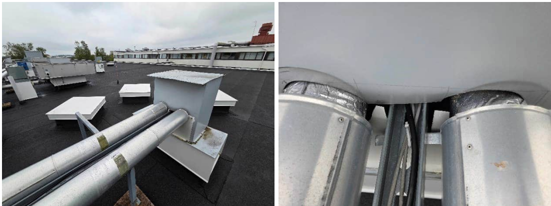
Kuvat 513 ja 514. LTO-koneen putkien läpivienti oli epätiivis.
