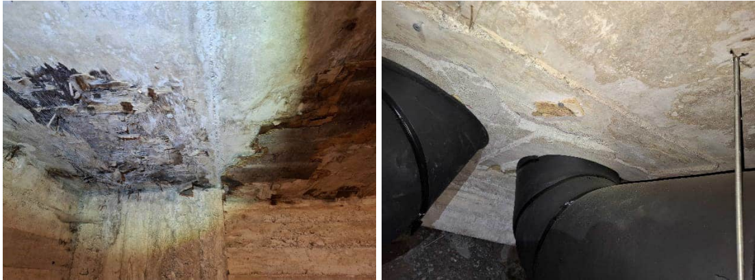
Kuvat 68 ja 69. Katon muottilevyissä havaittiin kosteusjälkiä ja korkeaa kosteutta piikkimittarilla. Ilmanvaihtokanavien läpivientejä ei ylettynyt tarkastamaan merkkisavulla.
