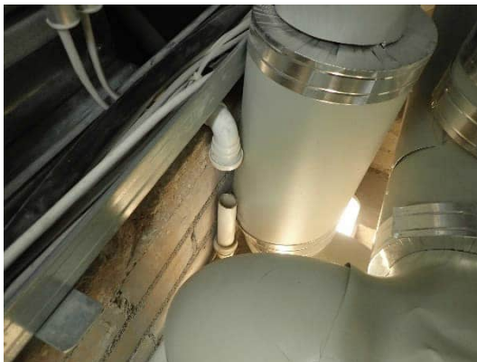
Kuva 614. Ulkoilmakammion viemäriputken liitoksen havaittiin olevan pois paikaltaan.
