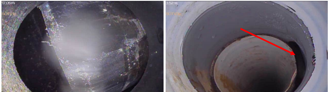
Kuvat 14 ja 15. Vasemmalla kuva linjan eteen tulevasta kaivon teleskoopista kuvauksessa SOTV1p. Oikealla kuva linjassa havaitusta paikaltaan lähteneestä tiivisteestä (tiiviste osoitettu nuolella) kuvauksessa SOTV3p.
