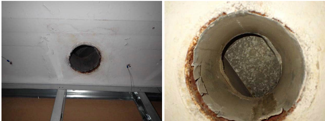
Kuvat 571 ja 572. Luokan D220 yläpohjassa havaittiin vanha tulppaamaton ilmanvaihtokanava, jonka läpiviennin ympärillä oli kosteusjälkiä.
