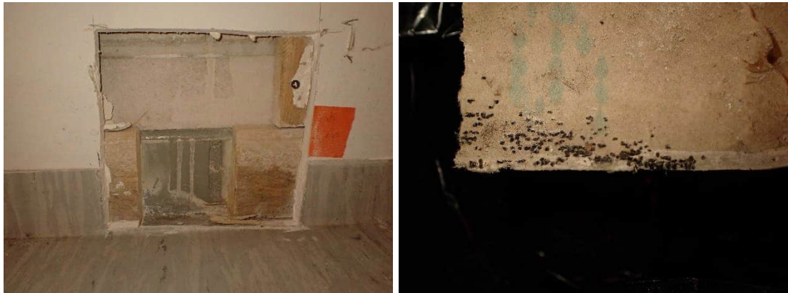
Kuvat 451 ja 452. Sosiaalitilan D033 väliseinän levytyksen avaus R46. Levytyksen taustapinnalla oli näkyvää mikrobikasvua.
