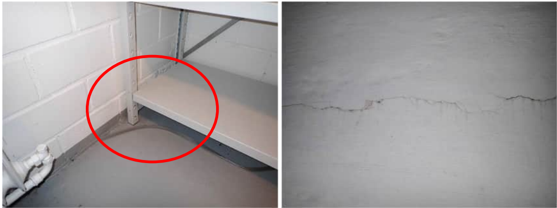
Kuvat 305 ja 306. A-osan varaston A050 hilseilevää maanvastaisen seinän tiilipintaa (soikio) ja portaanalusvaraston A019 maanvastaisen seinän halkeaman kosteusjäljet.
