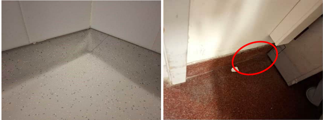
Kuvat 80 ja 81. C-osan kellarin suihkutiloissa muovimatot olivat paikoin irti alustastaan ylösnoston kohdalla. Kellarin massalattiassa havaittiin halkeamia (korostettu punaisella).
