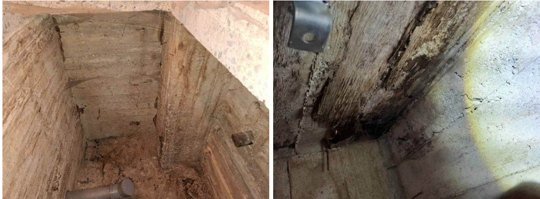
Kuvat 127 ja 128. Käytävän A001c alapohjan luukun avaus R30. Kanaalissa havaittiin muottilautoja ja -levyjä, joissa oli merkkejä kosteudesta, mikrobikasvusta ja lahovaurioista.
