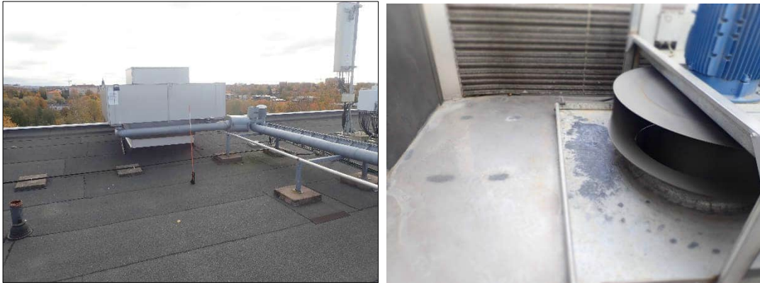
Kuvat 615 ja 616. Yleiskuvat poistoilmakoneesta TK05PK01 ulkopuolelta ja sisäpuolelta. Puhaltimen havaittiin hieman vapisevan käynnin aikana, mutta poikkeavia käyntiääniä ei havaittu. Neulapatterit olivat silmämääräisten havaintojen perusteella puhtaat.
