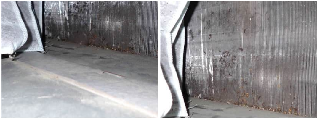
Kuvat 647 ja 648. Yleiskuvat tuloilmakoneen suodatinosasta ja lämmityspatterista. Suodatinosan pohjalla havaittiin hieman pölyä, ja patteri oli huomattavan likainen.
