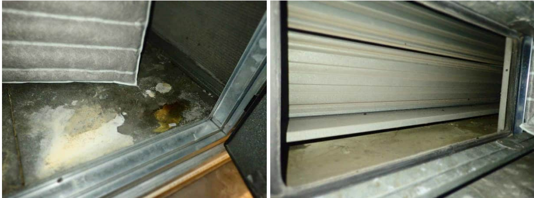
Kuvat 600 ja 601. Yleiskuvat tuloilmakoneen suodatinosasta ja ulkoilmapellistä. Koneen sisällä havaittiin runsaasti kosteusjälkiä suodatinosan pohjalla ja ulkoilmapellin havaittiin jäävän osin auki sulkeutuessa.
