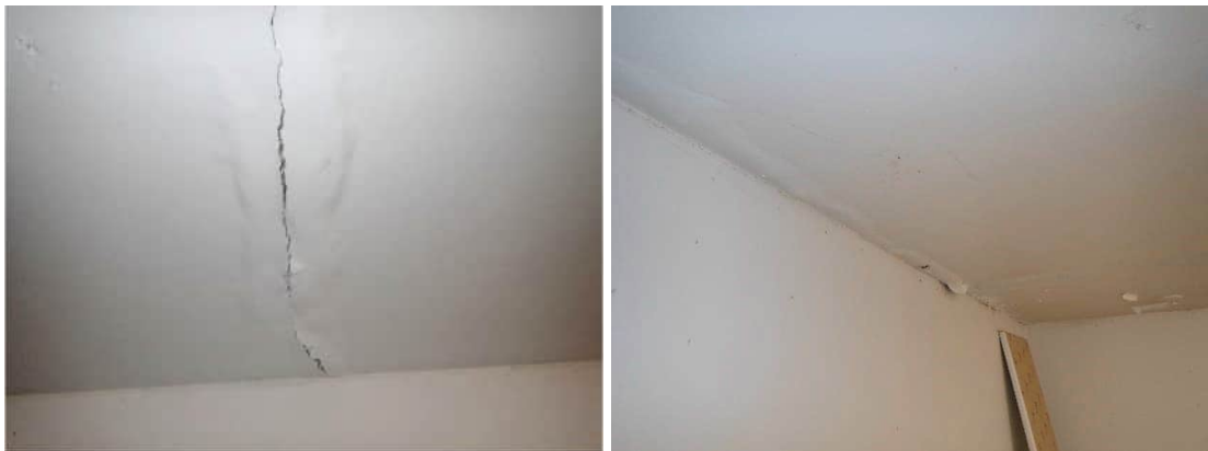
Kuvat 552 ja 553. Varaston D039 maalatun betonipintaisen katon kosteusjälkiä.
