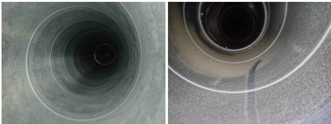
Kuvat 703 ja 704. Yleiskuvat tuloilmakanavien sisältä. Vasen kuva on D-osan tuloilmalaitteen kytkentäkanavasta ja oikean puolen kuva on A-osalta tuloilmalaitteen kytkentäkanavasta. Kanavissa oli hieman pölyä.
