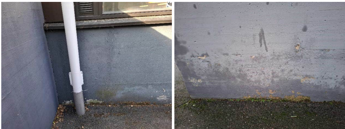
Kuvat 268 ja 269. Koillissivun D-osan tukimuuriin rajautuva nurkka ja seinän alaosan leväkasvua sekä teknisen työn luokan D004 kohdalla maalipinnan hilseilyä.
