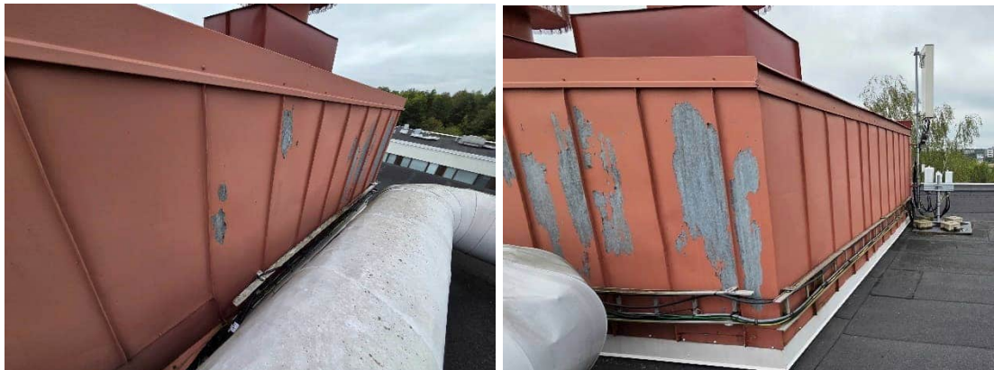
Kuvat 487 ja 488. IV-konehuoneen kaakonpuoleisen seinän maalipinta oli laajalti hilseillyt.
