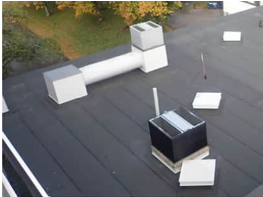
Kuva 597. Yleiskuva tuloilmakoneen TK03 vastaparina toimivista poistoilmapuhaltimista.
