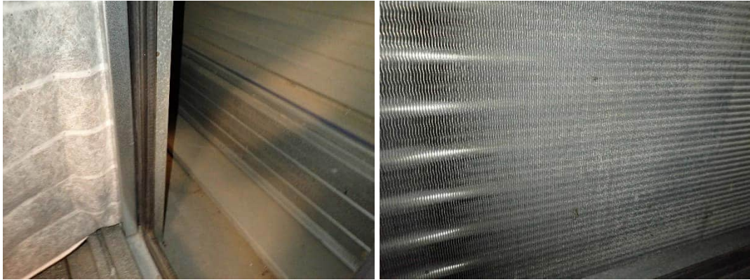
Kuvat 652 ja 653. Yleiskuvat ulkoilmapellistä ja LTO-patterista. Ulkoilmapelti ei tiivistynyt täysin kiinniasennossa ja LTO-patterin kenno oli hieman likainen. Suodatinosan pohjalla havaittiin vähäisiä kuivuneita kosteusjälkiä.
