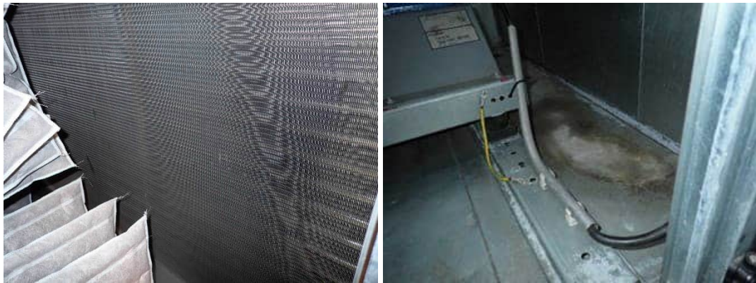
Kuvat 631 ja 632. Yleiskuvat poistoilmakoneesta TK07PK01 LTO-patterista suodatinosan puolelta ja puhallinosan pohjalta. Puhallinosan pohjalla havaittiin vanhoja kosteusjälkiä ja hieman ulkosäleikön kautta kulkeutunutta likaa.
