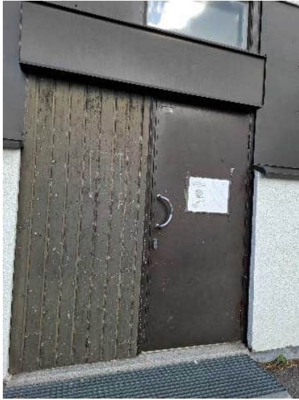
Kuva 393. Tilan A132 ulko-oven maalipinta on kulunut ja viereinen laudoitus on huonokuntoinen.
