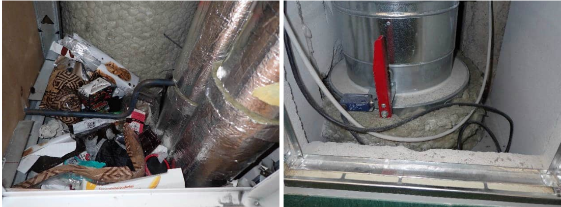
Kuvat 454 ja 455. Käytävä D102 koteloinnin avaus R4. Koteloinnin pohjalla oli runsaasti roskaa ja avointa mineraalivillapintaa. Luokka D206 hormin avaus R96. Hormin sisällä oli avointa mineraalivillapintaa.
