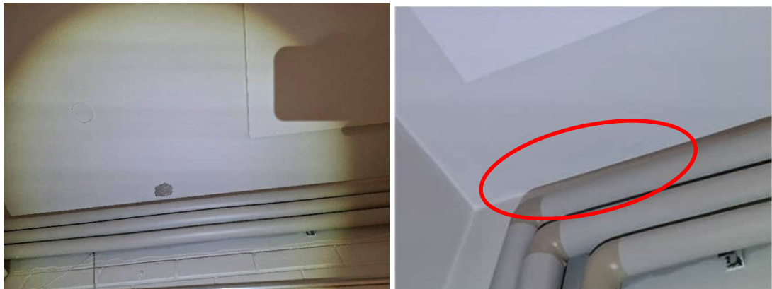
Kuvat 548 ja 549. Tasoitteen hilseilyä luokan B343 katossa.
