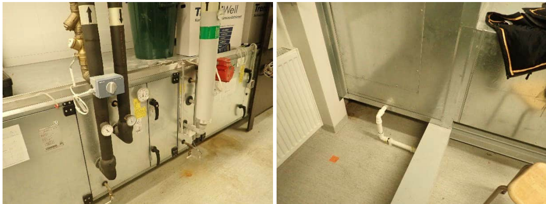
Kuvat 583 ja 584. Yleiskuvat ilmanvaihtokoneesta. Ulkoilmakammio oli varustettu viemäroinnilla, mutta lattialla oli vanhoja kosteusjälkiä.
