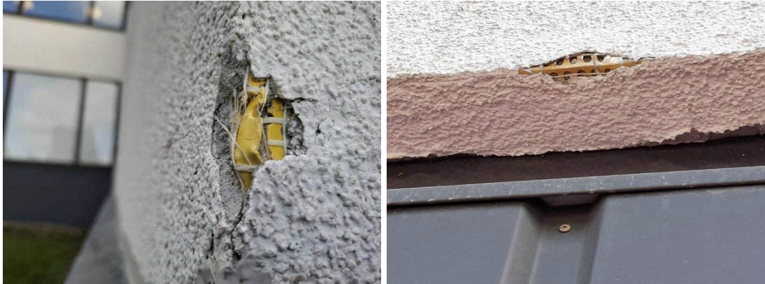
Kuvat 284 ja 285. Ulkoseinän rappaus oli lohjennut paikoitellen ja alta näkyi verkkoa ja eristettä.
