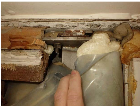
Kuva 350. Luokan A105 seinärakenteessa havaittu teräspilari.
