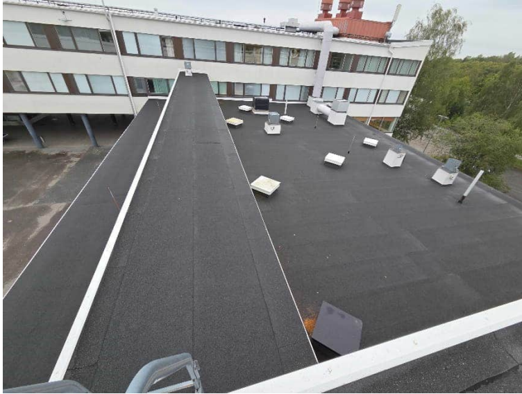
Kuva 534. C-osan yhdyskäytävän vesikatolla ja pienemmällä alemmalla vesikatolla ei ole yläpohjan tarkastusluukkuja.
