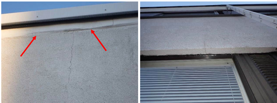
Kuvat 282 ja 283. Rappauspinnoissa havaittiin paikoitellen halkeamia. A-osan välituntipihan puolella seinän yläosassa erottui muusta seinäpinnan rappauksesta erottuva kaista, jonka alareunassa näkyi rappausverkkoa (nuolet).
