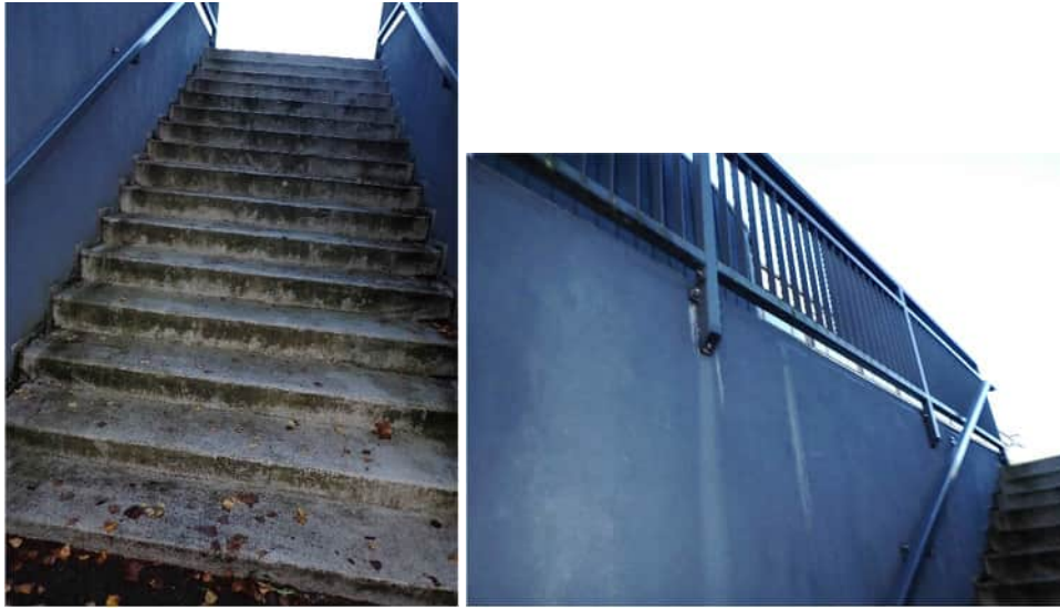
Kuvat 12 ja 13. D-osan välituntipihalle kulkevien portaiden vierellä betoniseinissä havaittiin kosteusjälkiä ja joitain halkeamia.
