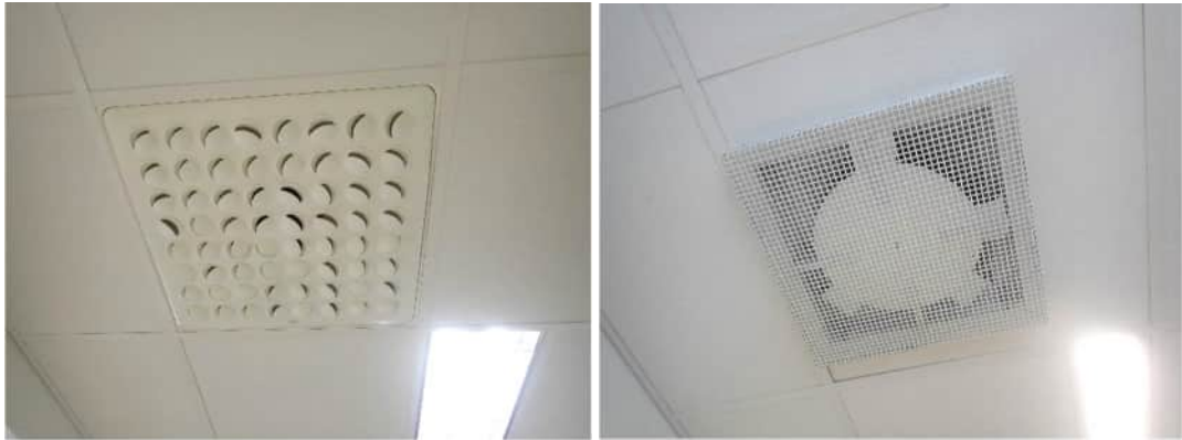
Kuvat 689 ja 690. Yleiskuvat tuloilmahajottajista. Vasemman kuvan päätelaite on A-osan tilasta A107 ja oikean kuvan päätelaite on B-osan tilasta B224. Tuloilmahajottajien tasauslaatikoiden äänenvaimennusmateriaalit olivat tarkasteluiden perusteella polyesterilevyjä tai kangaspäällysteisiä mineraalivillalevyjä.
