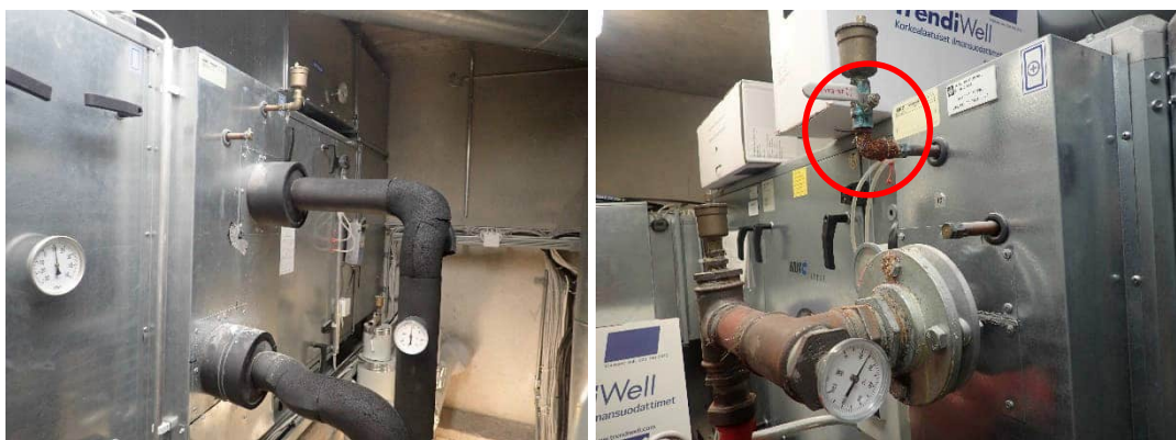
Kuvat 608 ja 609. Yleiskuvat tuloilmakoneesta TK05. Lämmityspatterin ilmausyhteen kulmaosan havaittiin olevan voimakkaasti ruostunut (merkitty kuvaan punaisella).
