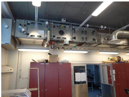
Kuva 640. Yleiskuva TK09 tuloilmakoneesta.
