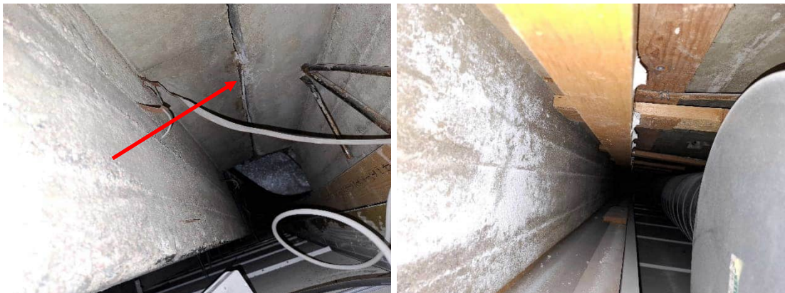
Kuvat 561 ja 562. Ulkoseinän vierellä yläpohjassa oli sauma, jossa oli kastuneen näköistä kovalevyä (nuoli). Ulkoseinän betonipalkissa havaittiin kalkkihärmää.
