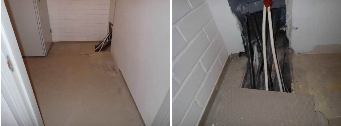
Kuvat 150 ja 151. Puhelinhuoneen D016 lattian epätiivis peltiluukku ja epätiivis seinäläpivihti, joista virtasi ilmaa huoneen suuntaan.
