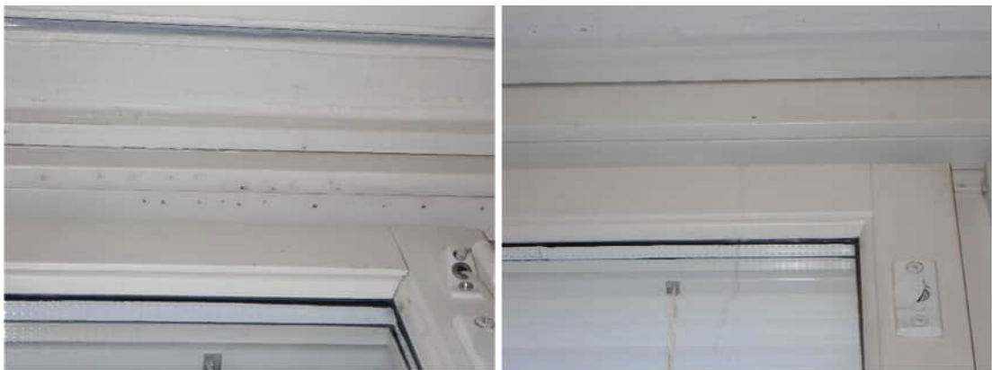
Kuvat 319 ja 320. Luokan B226 ja Luokan D129 ikkunoiden yläosissa on kosteusjälkiä.
