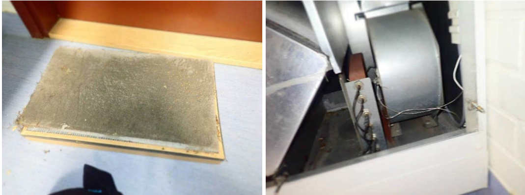
Kuvat 666 ja 667. Yleiskuvat tuloilmasuodattimesta ja tuloilmapuhaltimesta. Kasettimallisen tuloilmasuodattimen päällä oli erillinen karkeasuodatin. Suodattimen havaittiin olevan merkittävän likainen. Tuloilmapuhaltimen vieressä oli sähkötoiminen lämmityspatteri.
