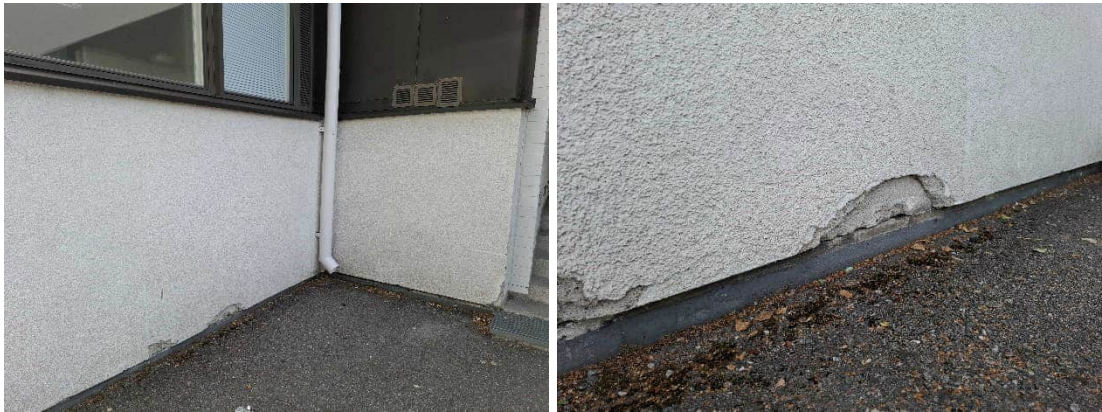
Kuvat 286 ja 287. Sisäpihalla ruiskubetonoinnin alareunasta oli lohjennut paikoitellen paloja.
