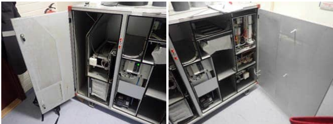
Kuvat 668 ja 669. Yleiskuvat ilmanvaihtokoneesta TK14.
