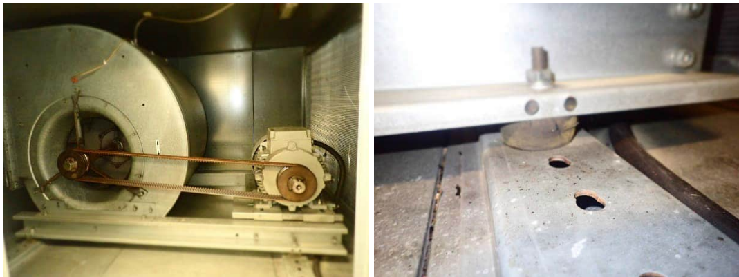
Kuvat 612 ja 613. Yleiskuvat tuloilmapuhaltimesta ja tärinänvaimennusjalasta. Puhaltimen hihnaveto-osat olivat silmämääräisten havaintojen perusteella kuluneet ja tärinän vaimennusjaloissa havaittiin halkeamia.
