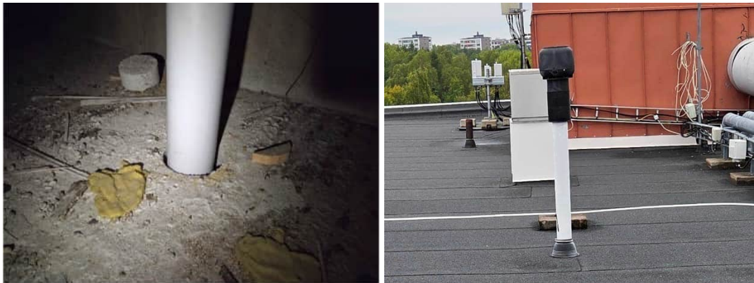
Kuvat 530 ja 531. B-osan yläpohjatilassa havaittiin uudempi viemärin tuuletusputki, jonka yläpohjan läpivientiä ei ollut tiivistetty. Tuuletusputken yläpäässä oli alipainetuuletin.
