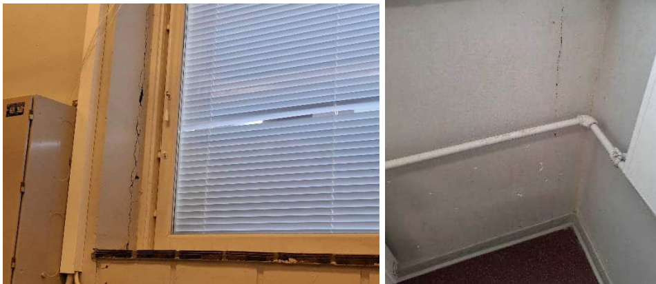
Kuvat 301 ja 302. Teknisen työn luokissa D004 ja D137 havaittiin yksittäisiä pystyhalkeamia ulkoseinissä.
