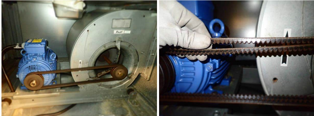
Kuvat 587 ja 588. Yleiskuvat tuloilmapuhaltimesta ja puhallinhihnoista. Puhallin oli puhdas, mutta hihnaveto-osissa havaittiin kulumaa ja hihnoissa halkeilua.
