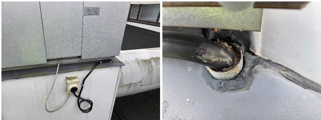
Kuvat 497 ja 498. Yksittäisen ilmanvaihtokoneen sähköjohdon läpivientikohdan massaus oli haurastunut ja vaikutti epätiiviltä.
