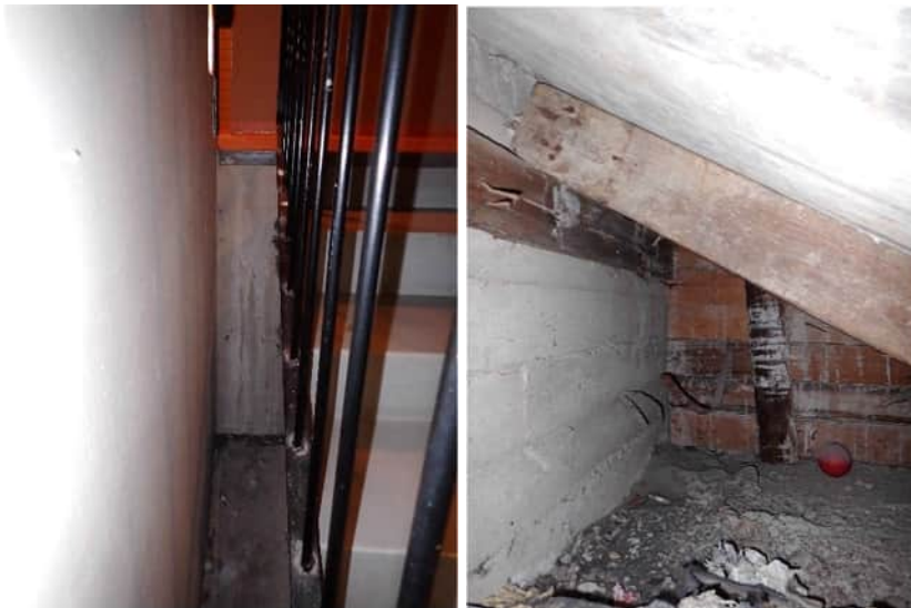
Kuvat 456 ja 457. Porrashuoneen A020 portaikon alla on tila, jonne ei ole pääsyä. Rakenteissa oli kiinni muottilautoja ja tilan pohjalla oli pölyä ja roskaa.
