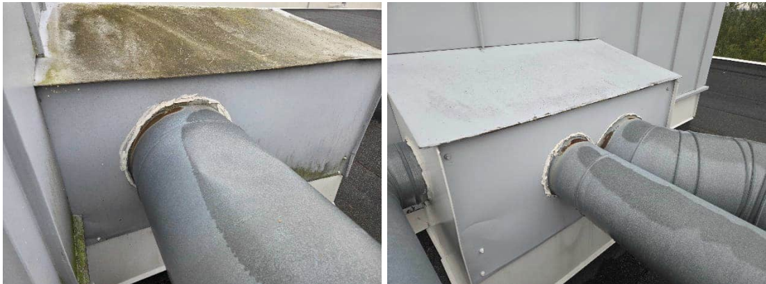
Kuvat 501 ja 502. Ilmanvaihtokanavien liittymien tiivistysmassaukset olivat paikoin haurastuneita.
