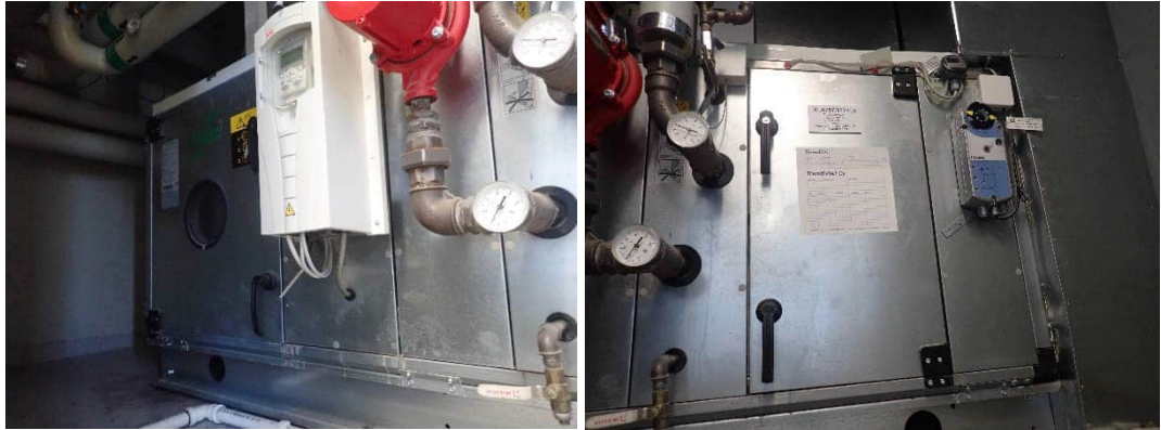
Kuvat 633 ja 634. Yleiskuvat TK08 tuloilmakoneesta.
