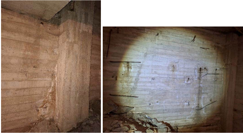
Kuvat 51 ja 52. A-osan alustatilan maanvastaisessa seinässä havaittiin useita kosteus- ja valumajälkiä.
