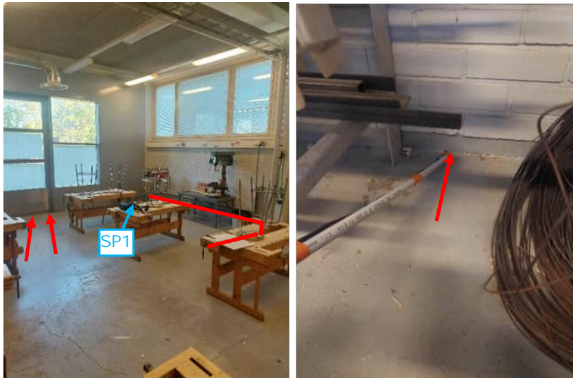
Kuva 163 ja 164. Luokan D010 merkkiainekokeessa MA3 havaitut ilmavuotopaikat on merkitty punaisilla nuolilla. Yhtenäiset vuotokohdat on esitetty kuvassa punaisella viivalla. Kaasun syöttöpiste (SP) on merkitty sinisellä nuolella.
