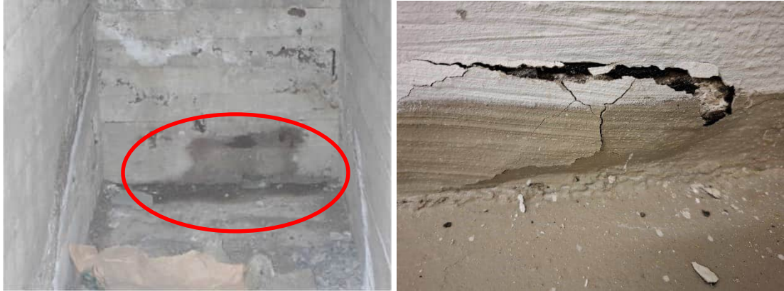
Kuvat 309 ja 310. Väestönsuojan D041 hiekkasuodatinhuoneen maanvastaisessa ulkoseinässä havaittiin näkyvää kosteutta (soikio). D-osan väestönsuojien maanvastaisten seinien tasoitepinnan alla havaittiin pikisivelyä. Sively ei sisältänyt asbestia.
