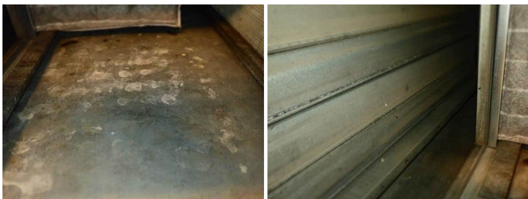
Kuvat 585 ja 586. Yleiskuvat tuloilmakoneen suodatinosasta ja ulkoilmapellistä. Koneen sisällä havaittiin kosteusjälkiä suodatinosan pohjalla ja ulkoilmapeltti ei havaintojen mukaan mennyt täysin kiinni sulkeutuessa.
