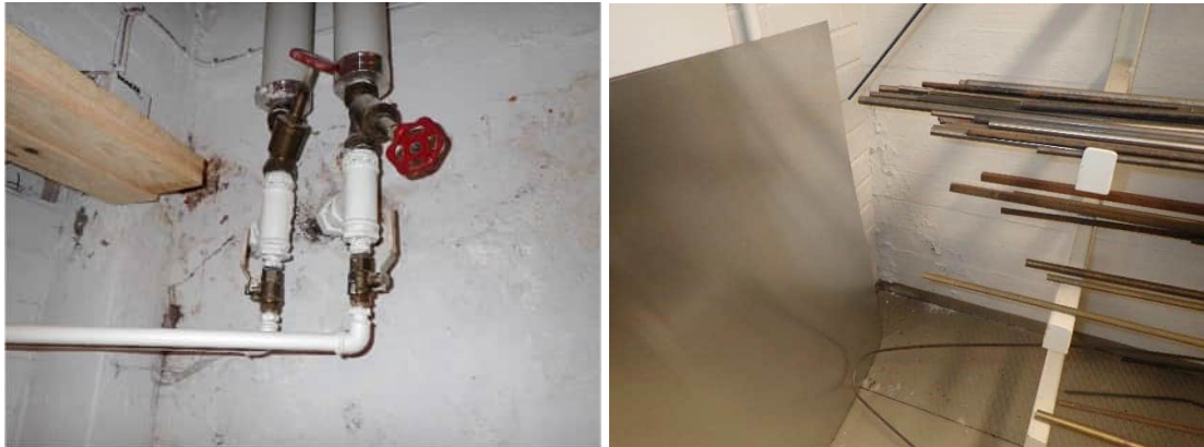
Kuvat 422 ja 423. Varaston D037 ja D048 väliseinät, joissa todettiin kosteuden aiheuttamaa pinnoitteiden irtoamista.
