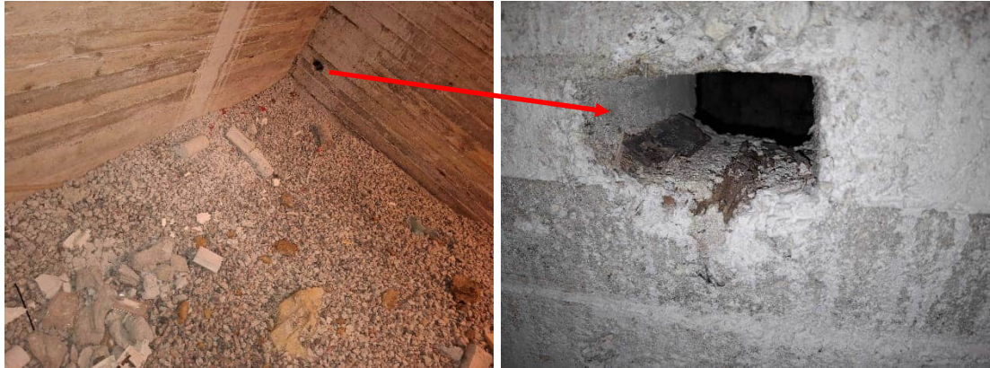
Kuvat 59 ja 60. Alustasta B014 on ilmayhteys C-osan alustatilaan takaseinällä olevan aukon kautta. Aukosta havaittiin merkkinavulla ilmavirtausta C-osan suuntaan.
