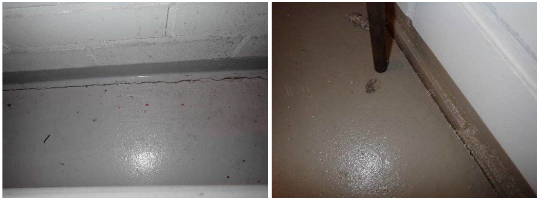
Kuvat 82 ja 83. D-osan kellarikerroksen maalatun betonilattian ulkoseinän vierellä olevia halkeamia teknisentyöluokassa D010 ja varastossa D048.
