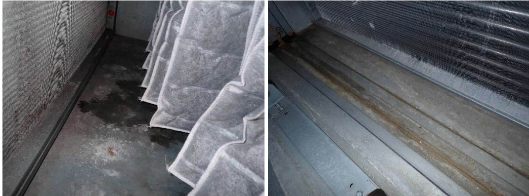
Kuvat 577 ja 578. Yleiskuvat tuloilmakoneen suodatinosasta sekä LTO- ja puhallinosan välisestä liitoksesta. Koneen sisällä havaittiin kosteusjälkiä suodatinosan pohjalla. Lämmityspatterissa ja koneiden liitoskohdissa havaittiin vanhoja kosteusjälkiä sekä hieman likaantumista.
