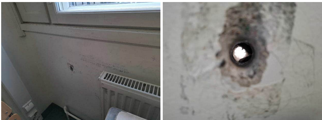
Kuvat 303 ja 304. Luokan D231 paikkaamaton vanha porareikä ulkoseinässä.
