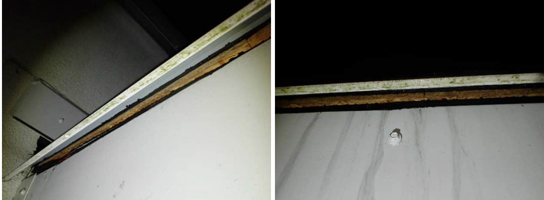
Kuvat 556 ja 557. Yhdyskäytävän C201 julkisivun ja vesikaton liitos ulkopuolelta. Yläpohjan yläpinnan vaneri oli näkyvillä, ja seinän yläosassa oli runsaasti valumajälkiä. Vesikaton veden poisto on toteutettu räystäältä ilman räystäskourua.
