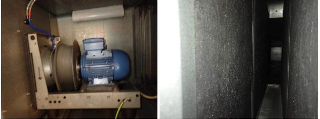
Kuvat 643 ja 644. Yleiskuvat tuloilmapuhaltimesta ja äänenvaimennusosan äänenvaimennuslevyistä.
