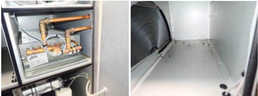
Kuvat 672 ja 673. Yleiskuvat lämmityspatterista ja suodatinosan pohjalta poistoilman puolelta. Lämmityspatterin päällä oli vetoniittien palasia ja suodatinosan pohjalla oli mustaa roskaa.
