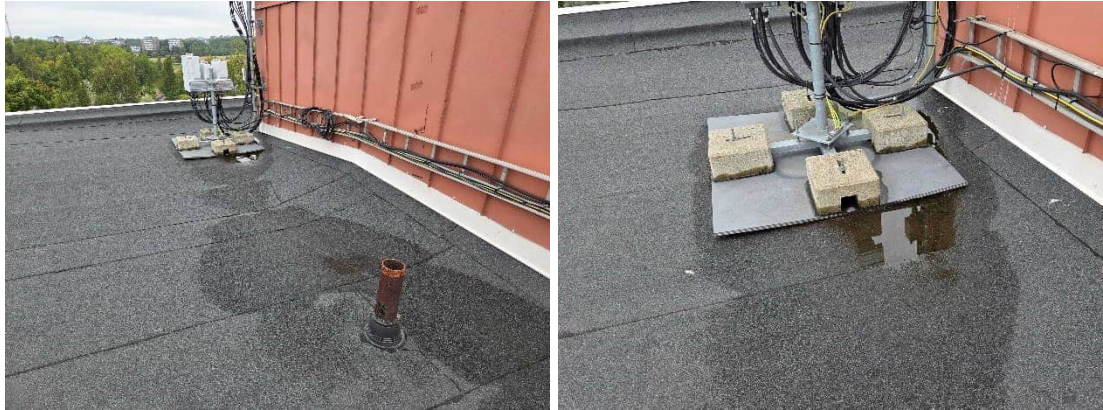
Kuvat 485 ja 486. Tarkastushetkellä vesi oli lammikoitunut IV-konehuoneen vierellä olevan antennijalustan kohdalle.
