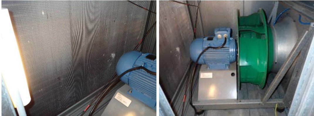
Kuvat 629 ja 630. Yleiskuvat lämmityspatterista puhallinosan puolelta ja tuloilmapuhaltimesta. Lämmityspatteri oli hieman likainen, mutta puhallin puhdas.
