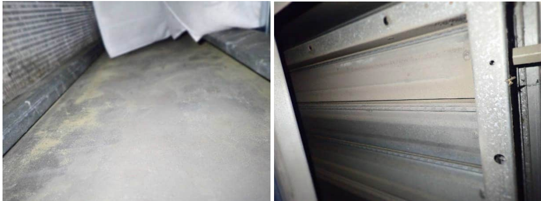
Kuvat 635 ja 636. Yleiskuvat tuloilmakoneen suodatinosasta ja ulkoilmapellistä. Suodatinosan pohjalla havaittiin hieman vanhoja kosteusjälkiä ja siitepölyä. Ulkoilmapelti ei havaintojen mukaan sulkeudu täysin kiinni-asennossa.
