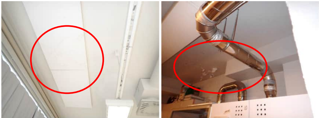
Kuvat 546 ja 547. B-osan kolmannen kerroksen luoteispäädyn tiloissa havaittiin kosteusjälkiä kattotasoitteissa, akustiikkalevyissä ja levykoteloinneissa. Kuvat ovat luokasta B340 ja varastosta B341.
