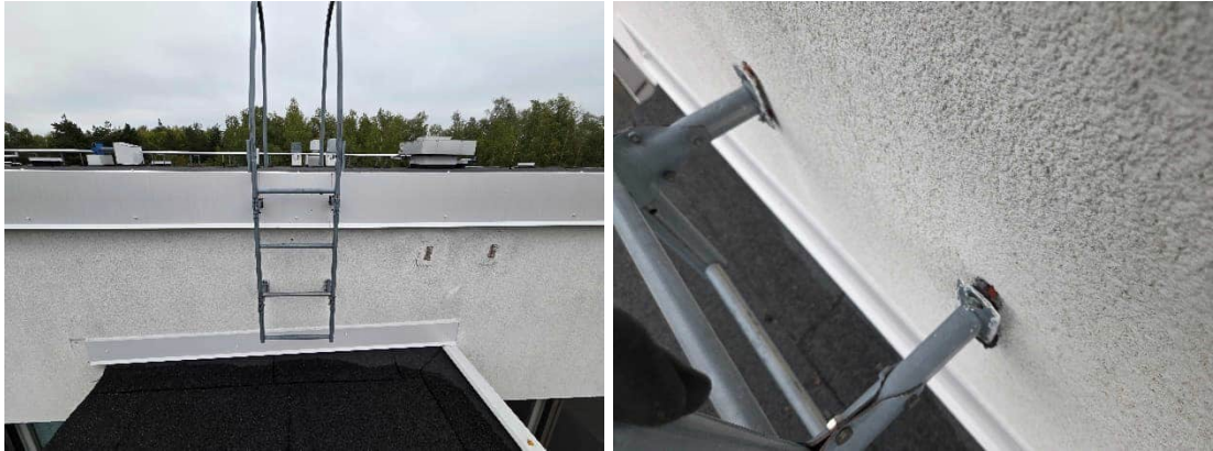
Kuvat 511 ja 512. C-osan yhdyskäytävän vesikatolle johtavien tikkaiden alempien seinäkiinnikkeiden kiinnitys oli pettänyt.
