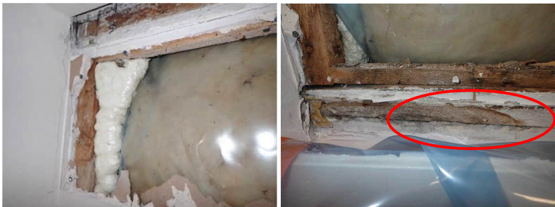
Kuvat 344 ja 345. Luokan A107 ulkoseinän levyverhouksen avaus R40. Höyrynsulkumuovi on asennettu runkouden sisäpintaan ja sitä on tiivistetty uretaanivaahdolla. Muovi oli hyvin epätiivis. rakenteessa oli vanhoja kosteusjälkiä ylä- ja alareunoissa. Alareunan tummunutta tasoitetta on korostettu soikiolla.
