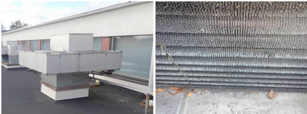
Kuvat 581 ja 582. Yleiskuvat poistoilmakoneesta TK01PK02 ja neulapatterista. Poistoilmakone TK01PK01 oli vastaavanlainen, mutta sen käynnissä havaittiin laakerivikaan viittaavaa käyntiääntä. LTO-neulapatterit olivat ulkopinnoiltaan lähes puhtaat.
