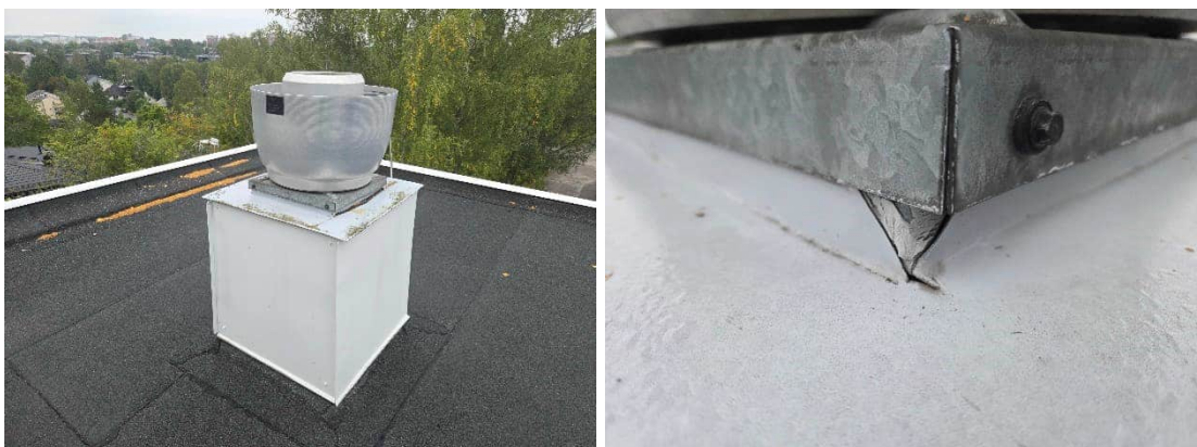
Kuvat 503 ja 504. IV-koneiden pellityksien tiivistysmassaukset olivat paikoin haurastuneita.
