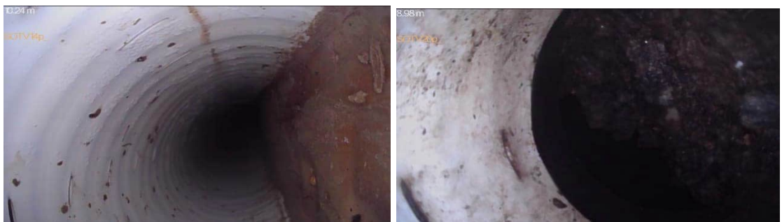
Kuvat 16 ja 17. Vasemmalla esimerkkikuva linjan pohjalla havaitusta hiekka/savikertymästä, kuva on kuvauksesta SOTV14p. Oikealla kuva linjan SOTV20p kuvauksen lopussa kaivon pohjalla olevasta hiekkakertymästä.
