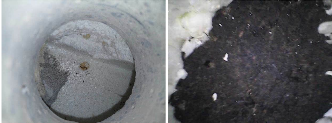
Kuvat 338 ja 339. Teknisen tilan A007 rakenneavaus R3 ja teknisen työn luokan D010 avaus R53. Teknisen työn luokan ulkoseinässä oli pikisively XPS-eristeen ulkopuolella betonipinnassa.
