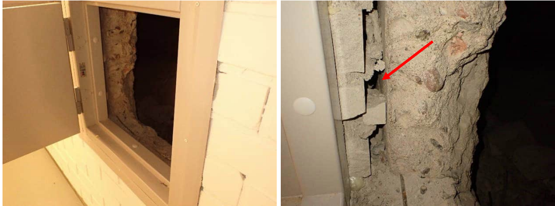
Kuvat 146 ja 147. C-osan alustatilan luukun kohdalta on ilmayhteys alustasta tiilimuurauksen ja betoniseinän väliin.
