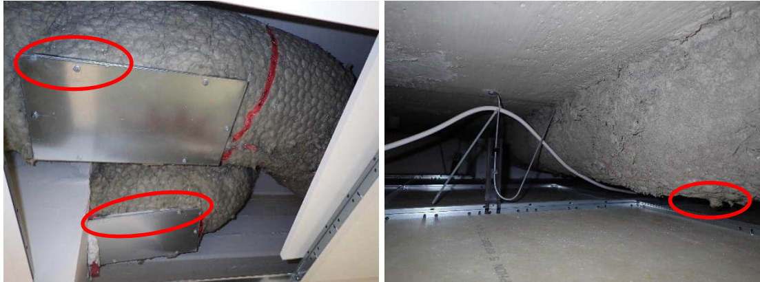
Kuvat 569 ja 570. Luokkien D220 ja D226 avauskohdissa R68 ja R66 havaittiin hieman kosteusjälkiä alakaton takana olevissa ilmanvaihtokanavien eristeissä tai tarkastusluukuissa.
