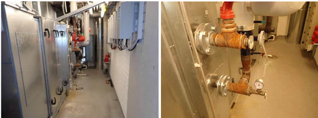
Kuvat 617 ja 618. Yleiskuvat tuloilmakoneesta TK06. Lämmityspatterin putkikytkennän osat olivat pintapuolisesti ruostuneet.
