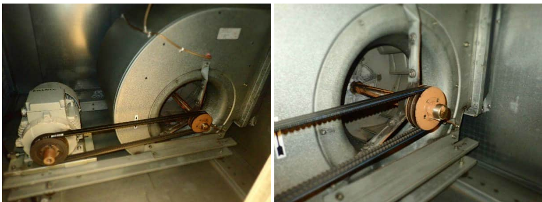
Kuvat 604 ja 605. Yleiskuvat tuloilmapuhaltimesta ja hihnaveto-osista. Hihnat olivat hyväkuntoiset, mutta hihnapyörät olivat kuluneet.
