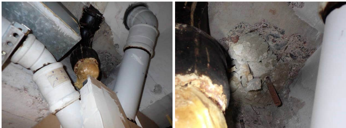
Kuvat 231 ja 232. Luokan B221 alakaton avaus R69. Valurautaviemäri on tukittu uretaanivaahdolla ja uusittujen viemäreiden läpivientien kohdalla on kosteusjälkiä timanttikorauksesta. Hormin kohdalla oli myös katkaistut kupariputket.
