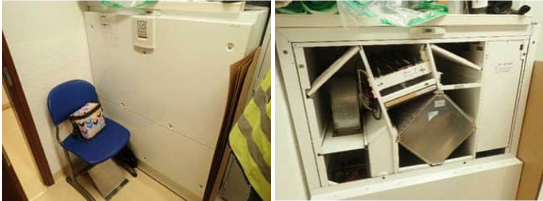
Kuvat 674 ja 675. Yleiskuvat ilmanvaihtokoneesta TK16. Tuloilmasuodatin oli malliltaan kasettisuodatin ja poistoilmasuodatin oli karkeasuodatinkangas.
