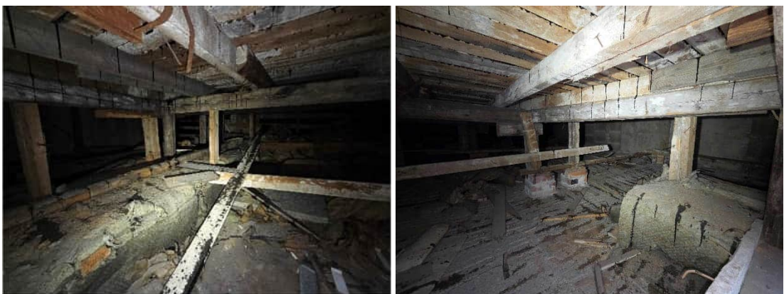
Kuvat 519 ja 520. Lounaispäädyn yläpohjatilan pohjalle on asennettu mineraalivillalla eristettyjä kanavia.
