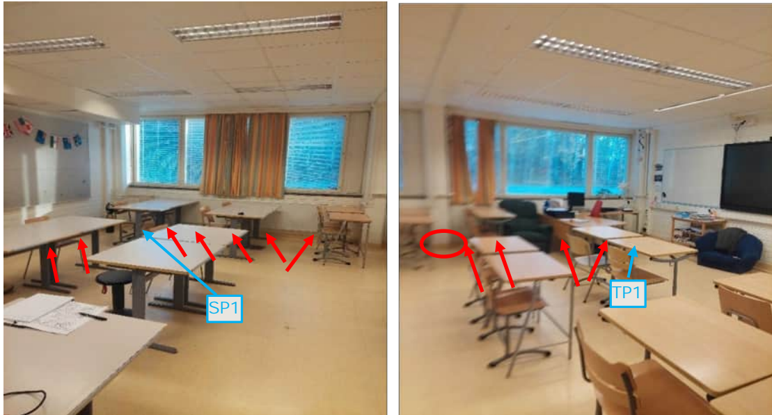
Kuva 165 ja 166. Luokan D012 alapohjan merkkiainekokeen MA1 havaitut pistemäiset il-mavuotopaikat on merkitty punaisilla nuolilla. Jatkuva vuotokohta pilarin liittymässä on esi-tetty punaisella soikiolla. Kaasun syöttökohta (SP) ja tarkastuspiste (TP) on merkitty sinisillä nuolilla.
