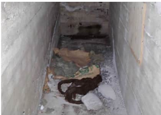
Kuva 89. Väestönsuojan D041 hiekkasuodatinhuoneen pohjalla oli rakennusjätettä ja ulkoseinän vierellä näkyvää kosteutta.
