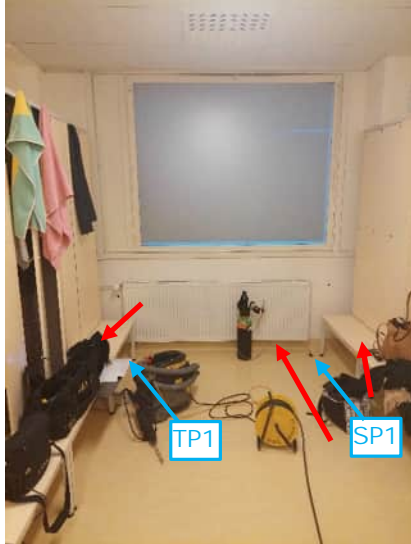
Kuva 154. Pukuhuoneen A008 merkkiainekokeessa MA8 havaitut ilmavuotopaikat ennen muovimaton ylösnoston raottamista on merkitty punaisilla nuolilla. Kaasun syöttöpiste (SP) ja tarkastuspiste (TP) on merkitty sinisillä nuolilla.
