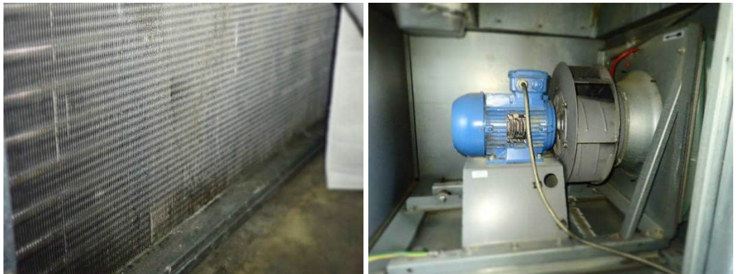
Kuvat 637 ja 638. Yleiskuvat lämmityspatterista suodatinosan puolelta ja tuloilmapuhaltimesta. Lämmityspatteri oli likainen ja puhallinosassa havaittiin myös siitepölyjäämiä.
