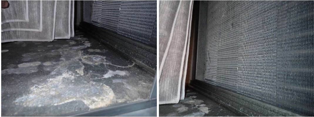
Kuvat 641 ja 642. Yleiskuvat tuloilmakoneen suodatinosasta ja lämmityspatterista. Suodatinosan pohjalla havaittiin hieman vanhoja kosteusjälkiä, kosteusjälkiä havaittiin myös patterissa, mutta ei pölyntymistä.
