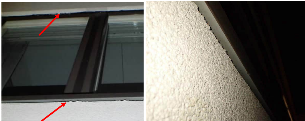
Kuvat 297 ja 298. Ikkunoiden ylä- ja alaliittymissä havaittiin mahdollisia epätiiveyskohtia.
