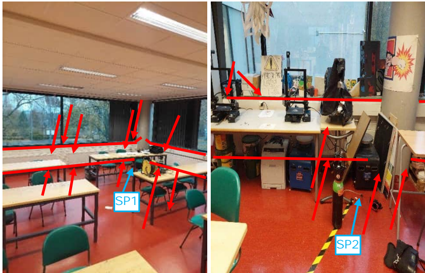
Kuva 159 ja 160. Luokan B013 merkkiainekokeessa MA10 havaitut pistemäiset ilmavuoto- paikat on merkitty punaisilla nuolilla. Jatkuvat vuodot on merkitty punaisella viivalla. Kaasun syöttöpisteet (SP) on merkitty sinisillä nuolilla. Kaasu levisi alapohjasta ulkoseiniin.
