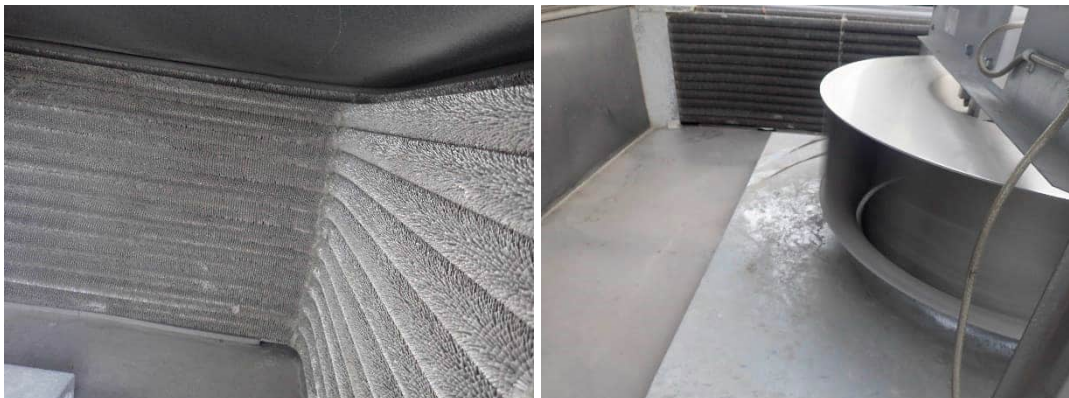
Kuvat 623 ja 624. Yleiskuvat poistoilmakoneesta TK06PK01 sisäpuolelta (poistoilmapuhallin TK06PK02 on vastaava). Puhaltimien havaittiin hieman vapisevan käynnin aikana, mutta poikkeavia käyntiäänä ei havaittu. Neulapatterit olivat silmämääräisten havaintojen perusteella hieman pölyiset.
