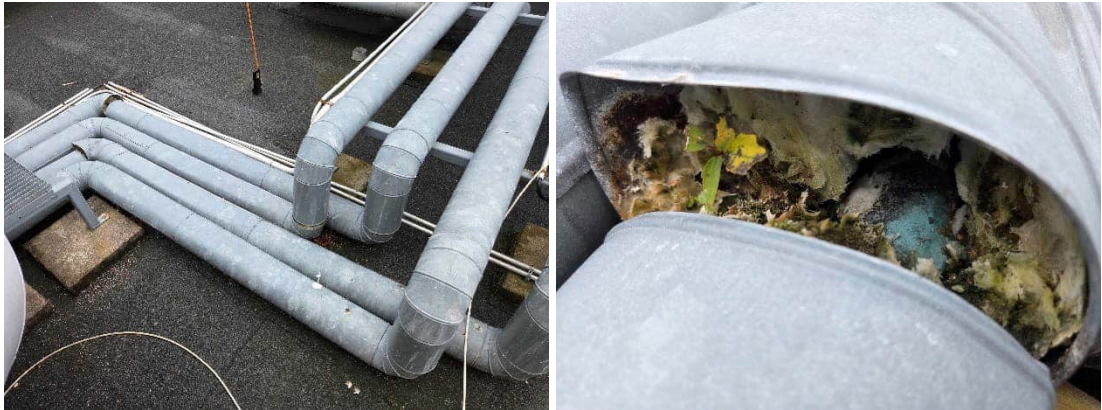
Kuvat 493 ja 494. Lämmöntalteenottokoneiden putkieristeiden peltisuoja oli monin paikoin auennut liitoksistaan ja eristevillat sekä putket olivat osin näkyvillä.
