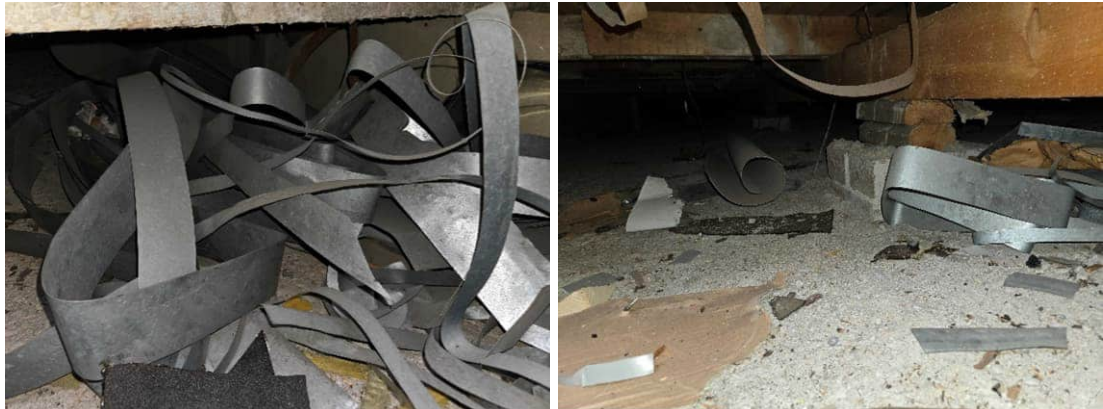
Kuvat 526 ja 527. B-osan yläpohjatilassa havaittiin vanhoja pellinkappaleita ja muuta rakennusjätettä.
