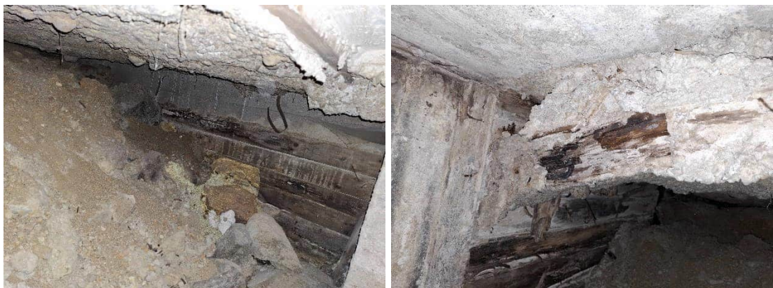
Kuvat 125 ja 126. Käytävän A001a alapohjan luukun avaus R79. Kanaalissa havaittiin muottilautoja, joissa oli merkkejä kosteudesta, mikrobikasvusta ja lahovaurioista. Kanaalissa on vahva mikrobiperäinen haju ja maakellarimainen haju.
