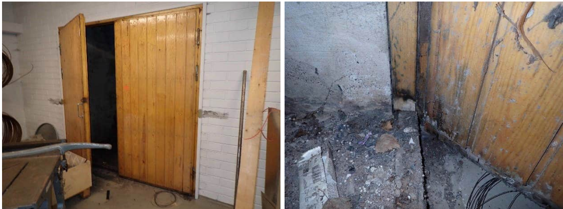
Kuvat 399 ja 400. Varaston D048 vanhan polttoaineluukun ovet olivat alareunastaan huonossa kunnossa, avaus R57.
