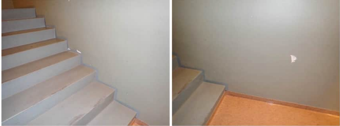
Kuvat 412 ja 413. A-osan porrashuoneen A011 kupruavaa seinäpintaa osin maanvastaisen seinän (väliseinän alaosa) kohdalla.
