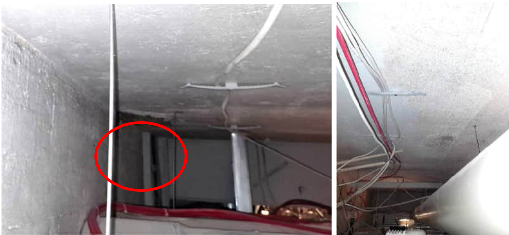
Kuvat 227 ja 228. Auditorion D021 alakaton avaus R56. Katon takana havaittiin mineraalivillalla tilkitty kolo (ympyrä) sekä uudelleenmaalaamattomia alueita, joissa vanha maalipinta hilseili.
