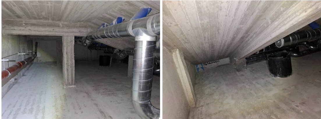
Kuvat 76 ja 77. Auditorion D021 lattian alla oleva alustatila on betonirakenteinen ja siellä on talotekniikkaa.
