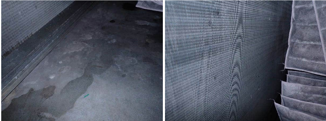
Kuvat 619 ja 620. Yleiskuvat tuloilmakoneen suodatinosasta ja LTO-patterista suodatinosan puolelta. Suodatinosan pohjalla havaittiin hieman vanhoja kosteusjälkiä ja LTO-patterin pinnalla hieman likaantumista.
