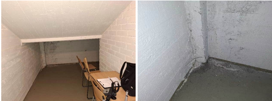
Kuvat 414 ja 415. Porrashuoneen D019 alla olevassa varastossa D020 maanvastaisella seinällä maali ja tasoite hilseilevät runsaasti, ja pinnoissa todettiin koholla olevia arvoja pintakosteusilmaisimella.
