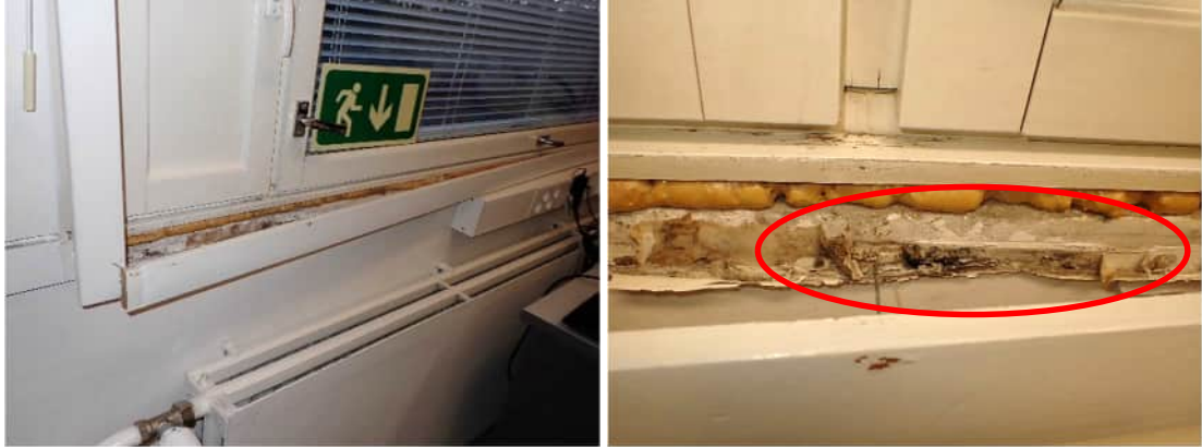
Kuvat 351 ja 352. Luokan A104 ikkunan alalistan avaus R43. Listan takana seinäpinnassa oli näkyvää mikrobikasvua (soikio).
