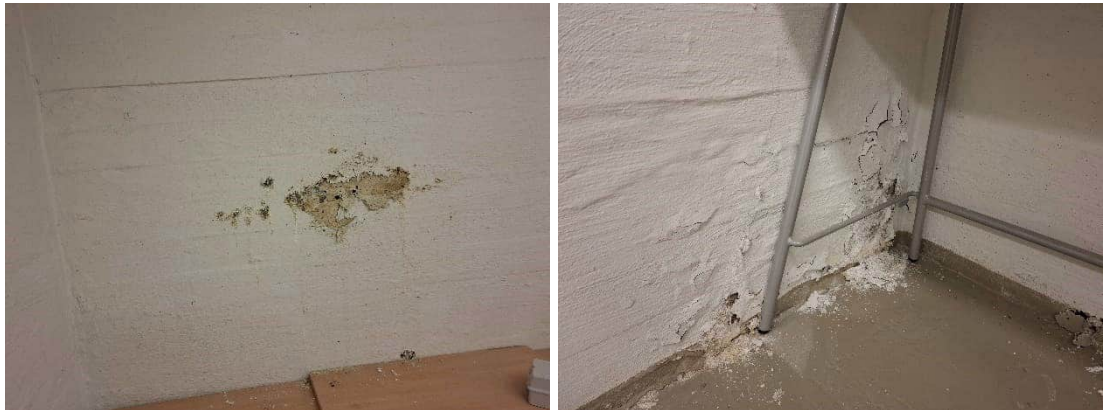
Kuvat 307 ja 308. D-osan väestönsuojien maanvastaisten seinien maali- ja tasoitepinnat hilseilivät ja seinissä oli kosteusjälkiä.
