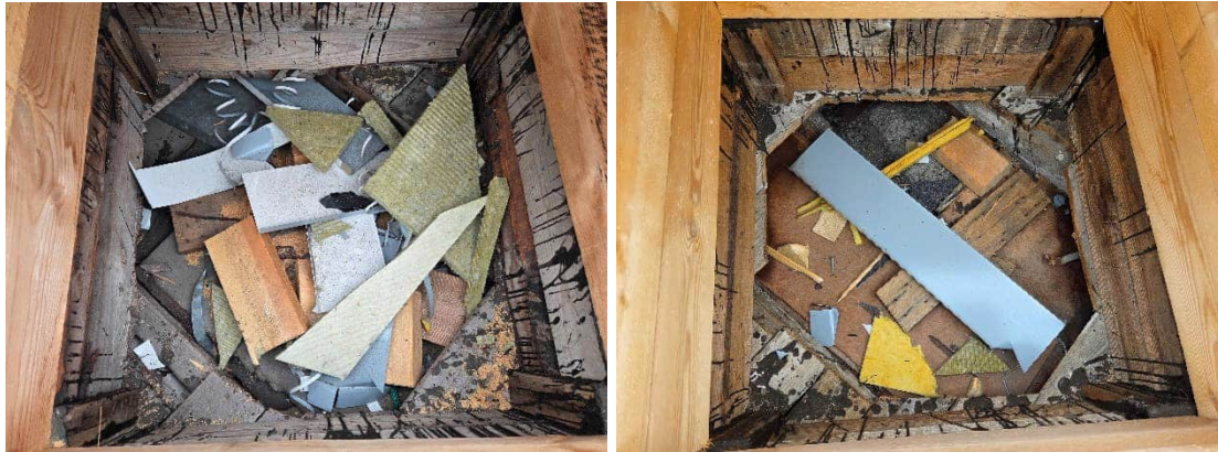
Kuvat 521 ja 522. Yläpohjan kaikkien muiden tarkastusluukkujen kulkuaukot oli ummistettu ja luukkujen pohjalla havaittiin rakennusjätettä.
