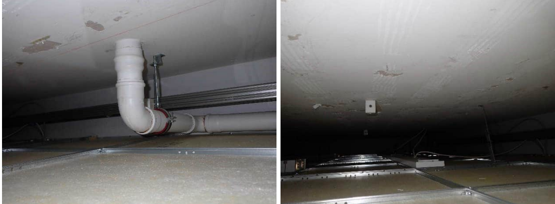
Kuvat 565 ja 566. Luokan B306 alakaton avaus R88. Viemäri­n yläpohjaläpivienti oli tiivis, ja yläpohjan pinnassa oli jälkiä akustiikkalevyjen poistosta.
