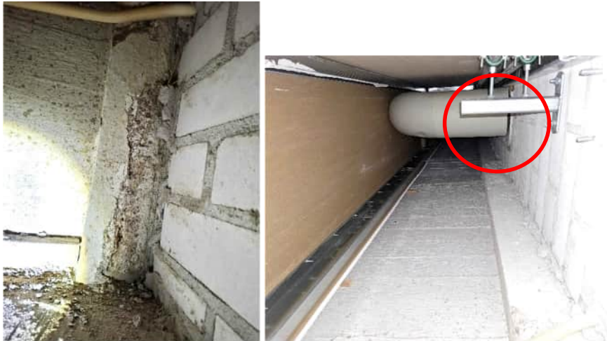
Kuvat 448 ja 449. Koteloinnin avaus R54 auditoriossa D021. Ulko- ja väliseinän nurkan pilarin alareuna oli lohkeillut ja ulkoseinässä oli ylempänä läpivienti (ympyrä).
