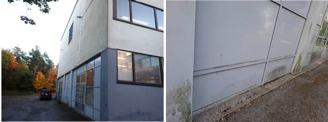
Kuvat 280 ja 281. D-osan luoteispäädyssä teknisen työn luokkien D004 ja D010 kohdalla on peltiverhottua seinää, jonka kohdalla havaittiin leväkasvustoa.
