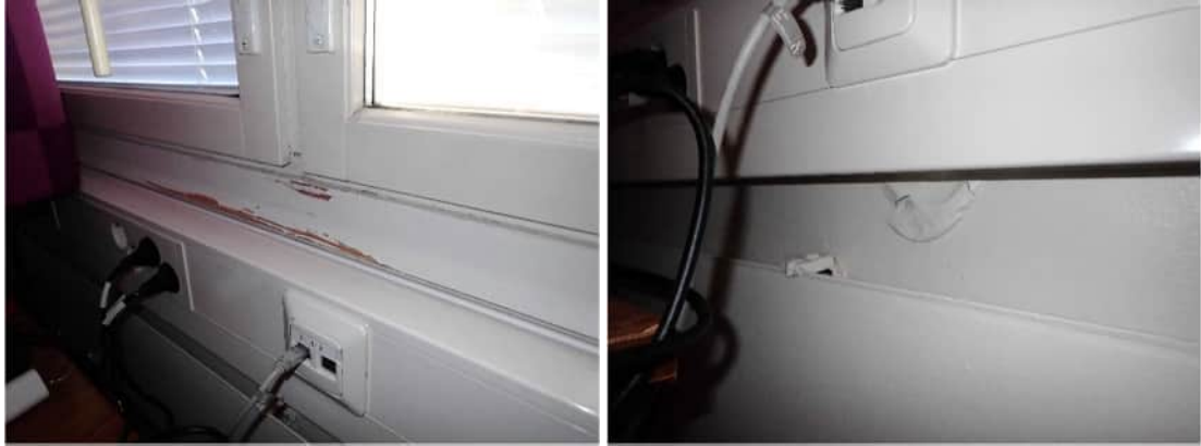
Kuvat 315 ja 316. Tilan A108 ikkunan alalistassa ja seinässä ikkunan alla oli selkeitä kosteusjälkiä.
