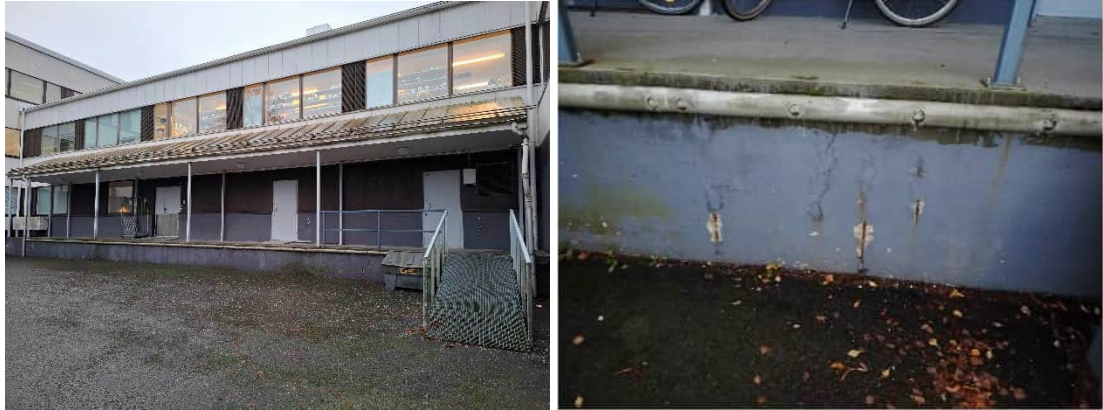
Kuvat 274 ja 275. Keittiön lastauslaiturin betonisesta etuseinästä on lohjennut betonia raudoitusten ruostumisen vuoksi.
