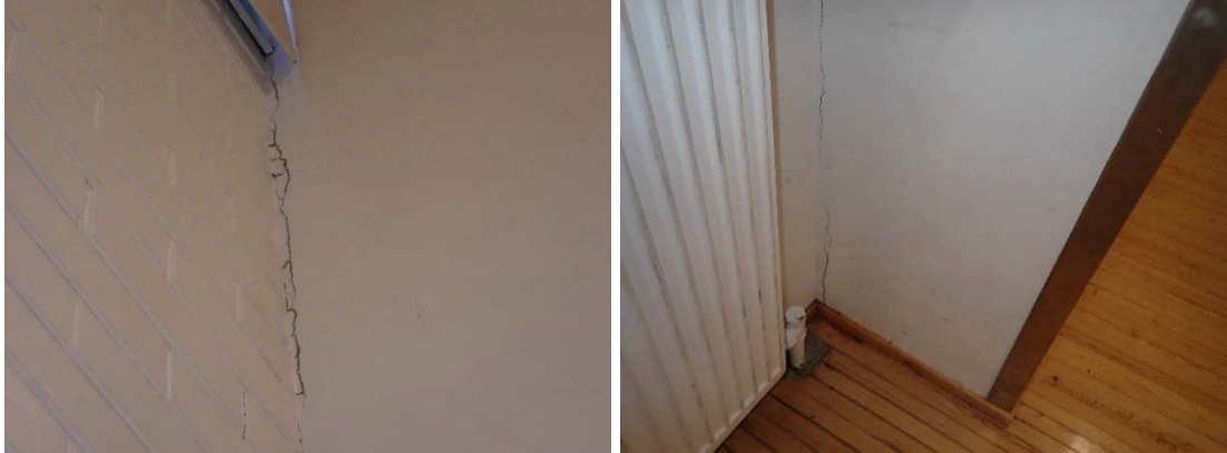
Kuvat 299 ja 300. Liikuntasalin A123 pilareiden halkeamat ulkoseinäliittymässä.
