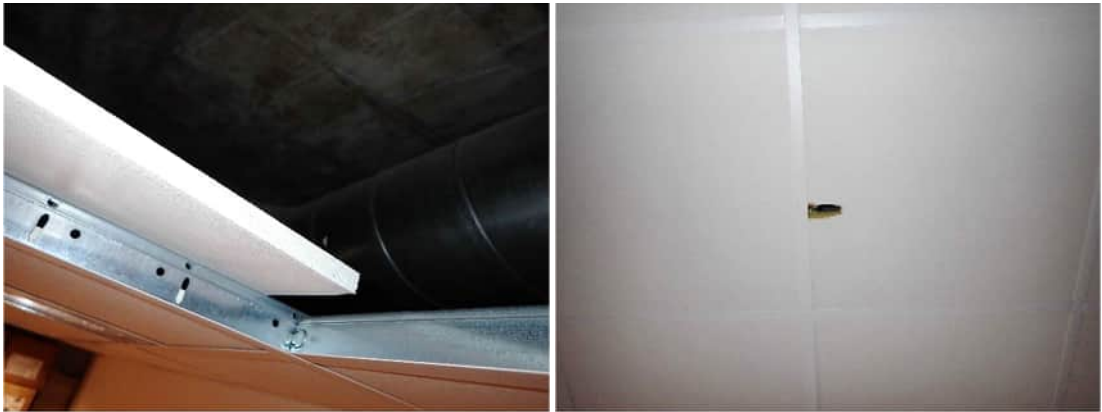
Kuvat 186 ja 187. Mineraalivillaisten alakattojen reunat oli pääosin pinnoitettu, mutta leikkauspinnat olivat pinnoittamatta.
