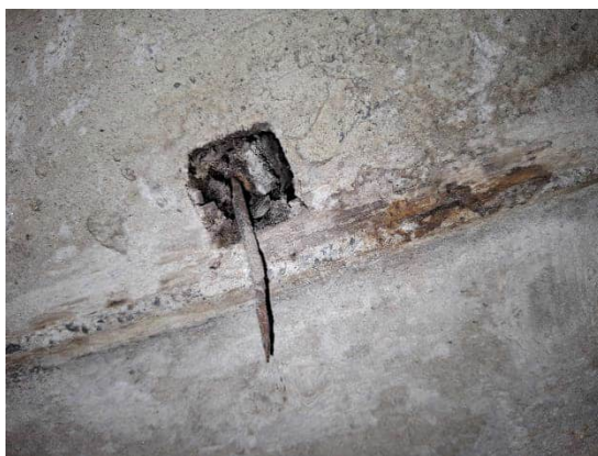
Kuva 63. Takaseinän sisällä oleva puu oli tummunut ja lahonnut.
