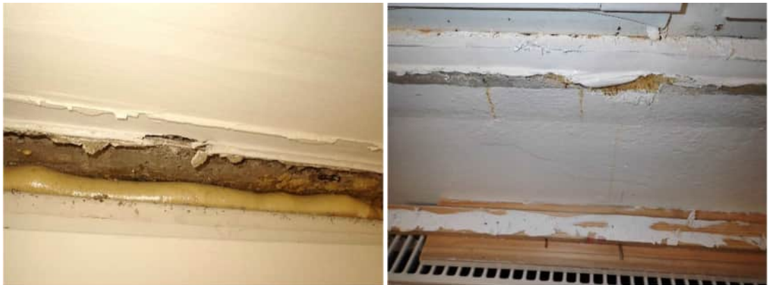
Kuvat 361 ja 362. Luokan B306 avauksessa R87 havaittiin ikkunan yläpielessä rako, joka jatkui yli 30 cm ylöspäin ja josta virtasi ilmaa luokkaan. Luokan D206 avauksen R89 alapuolella oli valumajälkiä seinäpinnalla. Tilkeväli oli massattu.
