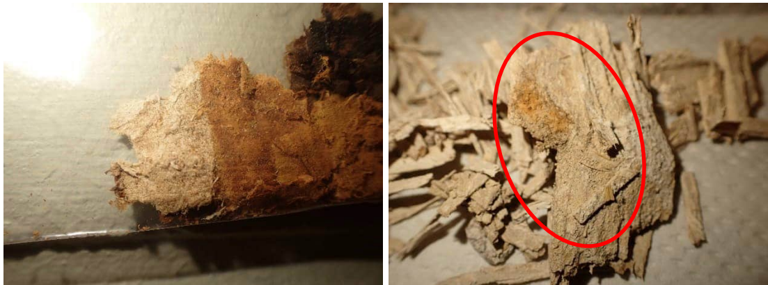
Kuvat 109 ja 110. Vasemmanpuoleisessa kuvassa pukuhuoneen A028 alapohjan sisällä olevaa asbestia sisältävää putkieristettä avauksesta R11 ja oikeanpuoleisessa kuvassa värimuutosta avauksen R10 lastuvillalevyssä.
