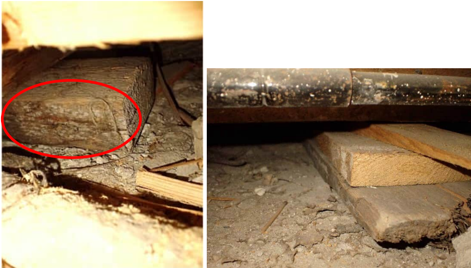
Kuvat 214 ja 215. Liikuntasalin A123 ulkoseinän viereen tehdyn avauksen R50 kohdalla lattian koolauksessa todettiin värimuutosta (soikio). Lattian alla on runsaasti pölyä ja roskaa. Kuvat avauksista R50 ja R51.
