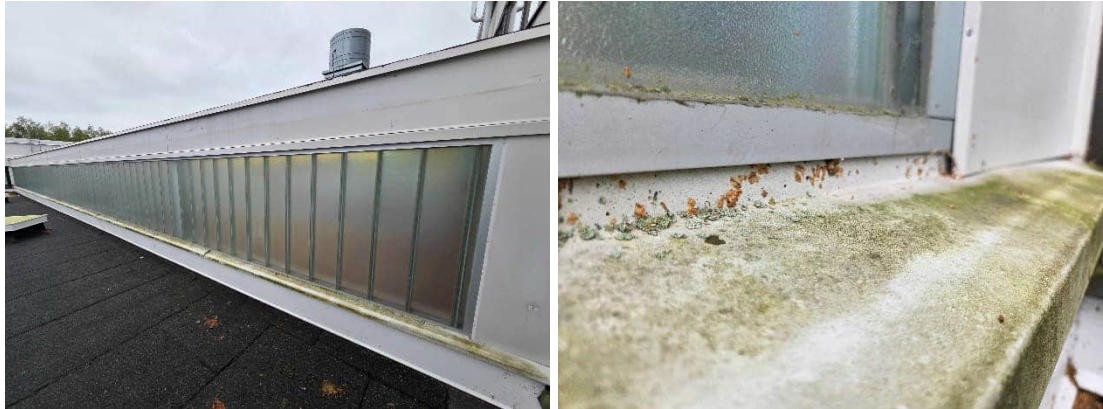
Kuvat 389 ja 390. Yhdyskäytävän ikkunapellityksessä havaittiin likaantumista ja sammalkasvustoa.
