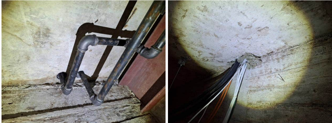
Kuvat 64 ja 65. Katon läpiviennit olivat epätiivittä, ja niiden kautta todettiin ilmavirtausta alustatilasta pois päin.
