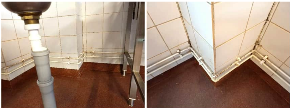
Kuvat 416 ja 417. Tummumista keittiön C112 seinän alaosan keraamisessa laatoituksessa ja saumoissa tiskipisteen nurkassa.
