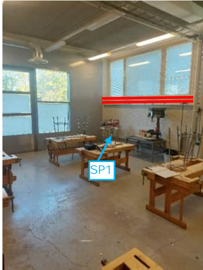
Kuva 375. Luokkahuoneen D010 ulkoseinän merkkiainekokeessa MA4 havaitut ilmavuodot on esitetty kuvassa punaisella viivalla (merkittävä vuoto). Kaasun syöttöpisteet (SP) on merkitty sinisellä nuolella.
