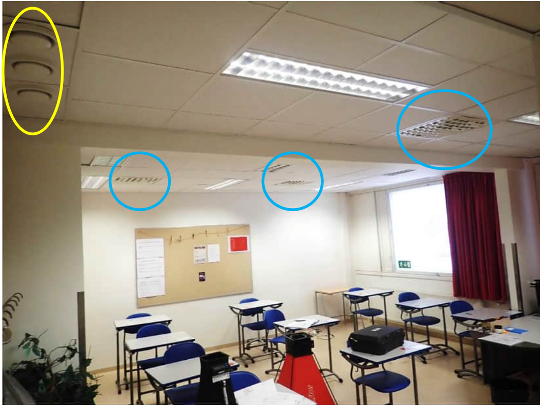
Kuva 684. Yleiskuva opetustilojen yleisesti käytetystä sekoittavan ilmanvaihdon ilmanjaosta. Tuloilmalaitteet (merkitty sinisellä) on kanavoitu keskelle tilaa ja poistoilmalaitteet (merkitty keltaisella) sijaitsevat tilan sivussa. Yksittäisissä opetustiloissa havaittiin syrjäyttävän ilmanvaihdon ilmanjako, missä tuloilma johdetaan piennopeuslaitteilla.
