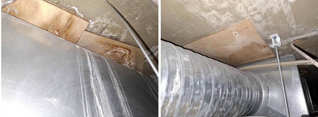
Kuvat 559 ja 560. Keittiön C112 alakaton avaus R71. Yläpohjassa havaittiin kosteusjälkiä ilmanvaihtokanavassa ja sen takana puulevyssä sekä yläpohjan betonissa.
