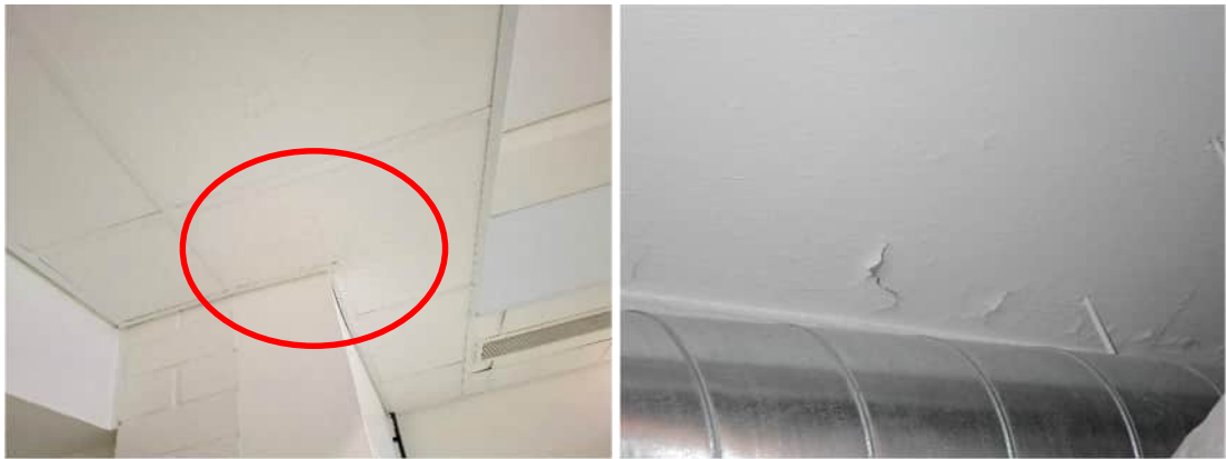
Kuvat 202 ja 203. Luokan B229 alakaton kosteusjäljet hormin vierellä sekä lämmönjakuhuoneen D023 katon maalipinnan lohkeilua.
