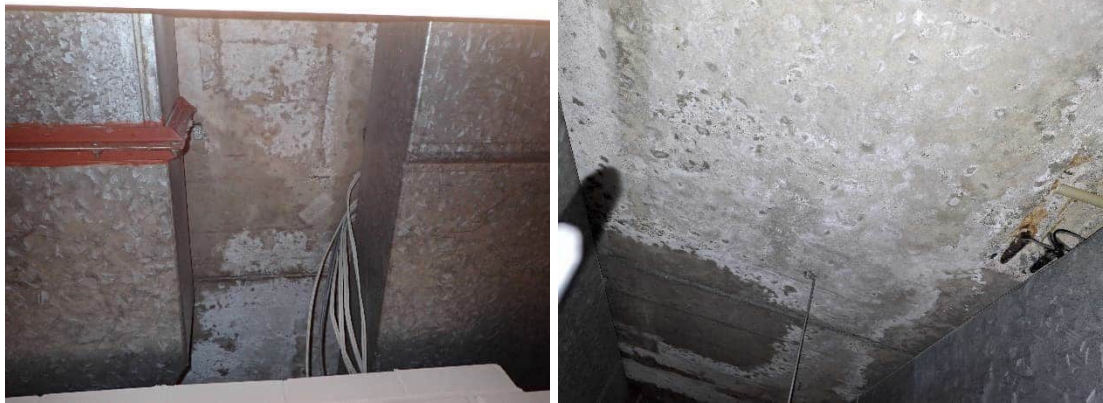
Kuvat 204 ja 205. Varaston B227 ja käytävän B202 katon kosteusjälkiä.
