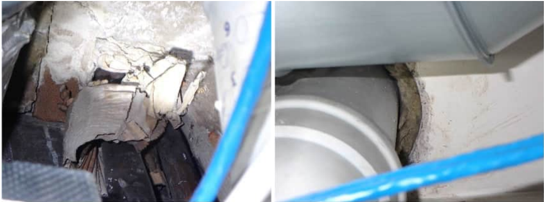
Kuvat 234 ja 235. Luokan B225 alakaton avaus R92. Hormin vierellä oli runsaasti vanhoja katkaistuja putkia sekä muottilevyä ja paperieristeitä. Osassa uusista viemäriämpivienneistä oli mineraalivillatilkke.
