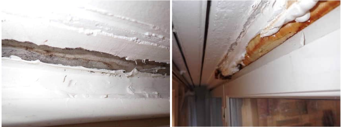
Kuvat 359 ja 360. Luokan B226 avauksessa R83 havaittiin kosteusjälkiä ikkuna yläpielessä. Ikkuna liittymät oli massattu. Luokan B340 avauksessa R86 liittymän massaus oli tehty osittain.
