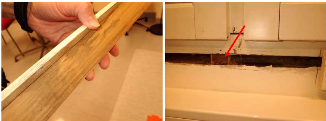
Kuvat 353 ja 354. Työhuoneen A109 ikkunan alalistan avaus R44. Listan takana havaittiin kosteusjälkiä ja vuotokohdan kiilapalassa todettiin kosteutta (nuoli). Ikkunan tilkkeitä oli poistettu.
