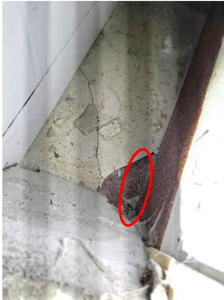
Kuva 106. Keittiössä C001 väliseinän ja kylmiön seinän välissä oli lohkeillutta tasoitetta lattian massapinnoituksen päällä. Tasoitteen alla havaittiin myös massapinnoitteessa halkeama (korostettu punaisella).
