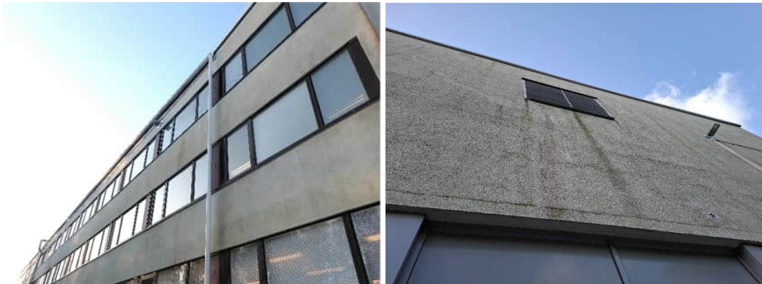
Kuvat 276 ja 277. Julkisivujen rappauspinnat olivat paikoin laikukkaat, etenkin D-osan koillissivun puolella. D-osan luoteispäädyssä olevan ilmanvaihdon säleikön alla oli valumajälkiä.
