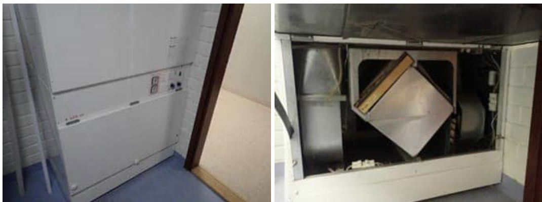
Kuvat 664 ja 665. Yleiskuvat ilmanvaihtokoneesta TK13. Koneen sisäosissa havaittiin likaa ja vanhoja kosteusjälkiä.
