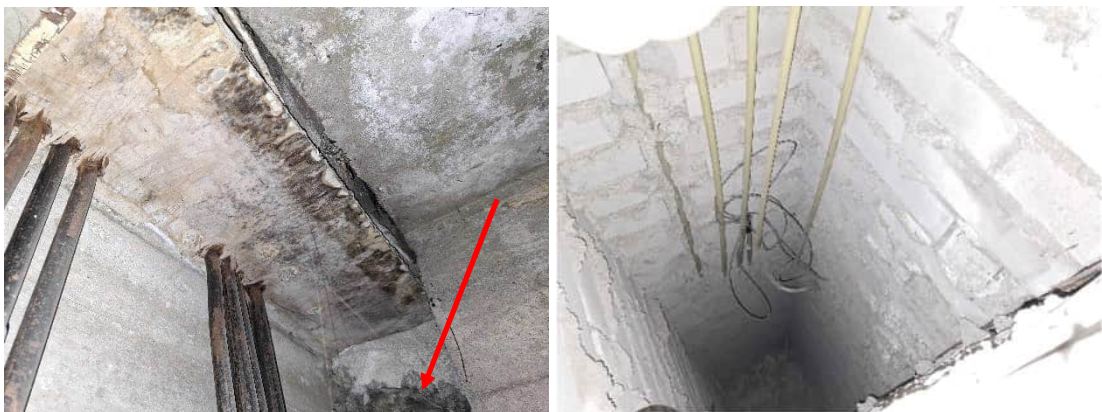
Kuvat 563 ja 564. Ruokalan ja ulkoseinän välisessä nurkassa on tiilirakenteinen hormi, jonka yläpuolella oli kastunutta ja mikrobivaurioitunutta muottilevyä. Tiilirakenteisessa holvissa on putkia ja hormin pohjalla oli rakennusjätettä. Ulkoseinän syvennyksessä on mineraalivillaa (nuoli).
