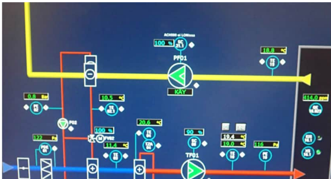
Kuva 710. Yleiskuva ilmanvaihtokoneen TK02 grafiikasta. Poistoilmapuhallin PF01 kävi täydellä 100 % käyntiteholla, ja tuloilman lämpötilä oli poistoilman lämpötilää korkeampi.
