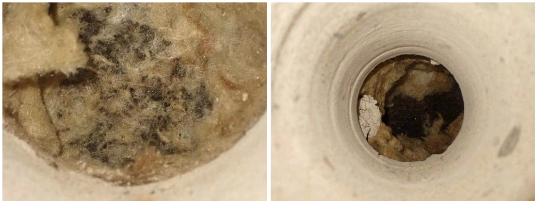
Kuvat 336 ja 337. Luokan D012 avauksessa R32 havaittiin oranssia värimuutosta seinän lämmöneristeessä (vasemmanpuoleinen kuva). Sosiaalitalan D033 avauksessa R45 todettiin mikrobiperäistä hajua (oikeanpuoleinen kuva).
