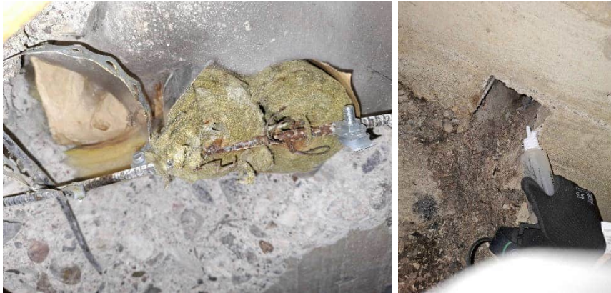
Kuvat 55 ja 56. Katon mineraalivillalla tukitusta läpiviennistä havaittiin ilmavuotoa alustatilan suuntaan. Ulkoseinän alareunan aukosta havaittiin ilmavirtausta poispäin alustatilasta.
