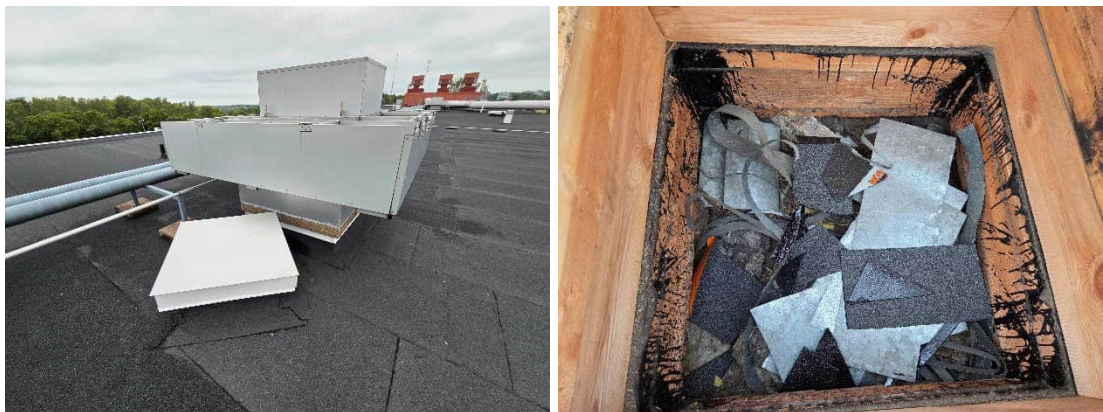
Kuvat 532 ja 533. B-osan vesikaton keskilinjalla sijaitsevan tarkastusluukun suuaukko oli täynnä rakennusjätettä. Kohdassa ei havaittu yläpohjatilaa, vaan mineraalivillaa ja sen alla betonia.
