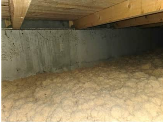
Kuva 537. Yhdyssäytävän seinän tuulensuojalevyissä oli valumajälkiä.
