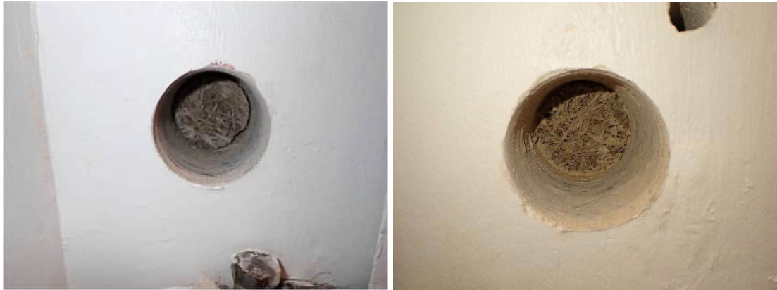
Kuvat 332 ja 333. Liikuntasalin A023 ulkoseinän avaukset R8 ja R9. Lastuvillaeristeessä todettiin mikrobikasvustoa.
