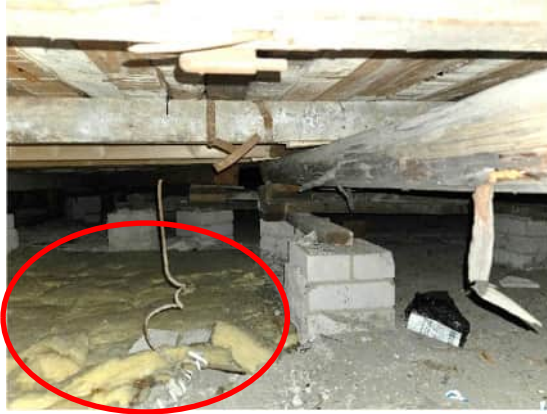
Kuva 525. Tilan A119 yläpuolella yläpohjan betonirakenteessa on mineraalivillalla ummistettu iso aukko, mahdollisesti vanha hormin kohta.
