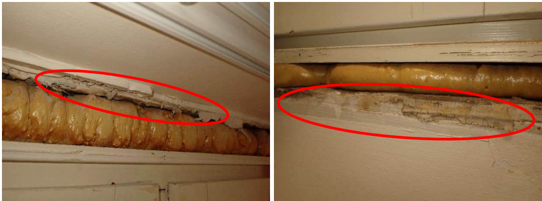
Kuvat 348 ja 349. Luokan A105 seinätasoihteessa ja ikkuna alla olevassa vanhassa tapetissa havaittiin kastumisesta aiheutunutta tummumista.
