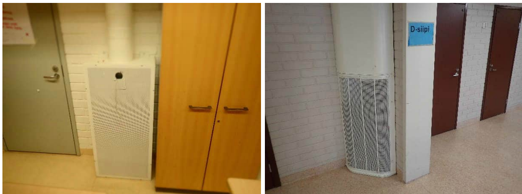
Kuvat 691 ja 692. Yleiskuvat tuloilman piennopeuslaitteista. Vasemman kuvan päätelaite on D-osan opetustilasta D012 ja oikean kuvan päätelaite D-osan käytävätilasta D111. Opetustila D012 oli ilmanjaoiltaan poikkeava muihin pistokokein kierrettyihin opetustiloihin nähden, eikä se havaintojen perusteella sovellu hyvin tilan käyttötarkoitukseen. Noin metrin päässä piennopeuslaitteesta on lähin pulpetti, missä ilmavirtaus tuntuu voimakkaasti. D-osan käytävällä, missä on syrjäyttävä ilmanvaihto, on lähtötietojen perusteella koettu puutteita sisäilman laadussa.
