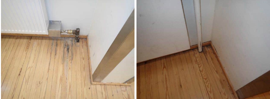
Kuvat 180 ja 181. Liikuntasalin A123 aiemmin paikallisesti kastunutta lautalattiaa.
