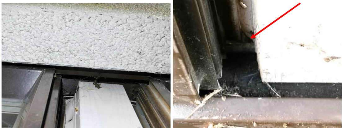
Kuvat 330 ja 331. Ikkunan välikarmin kohta ulkopuolelta avauksesta R77. Vesipellin ja karmin välissä on kolo (nuoli).
