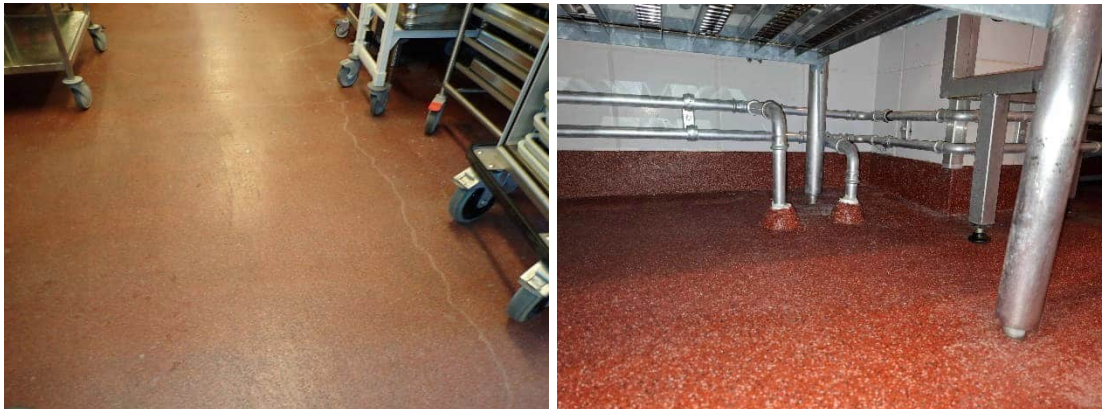
Kuvat 182 ja 183. Keittiön lattian massapinnoitteen pinnassa havaittiin halkeamia. Läpivienneissä ja ylösnostoissa ei havaittu puutteita.
