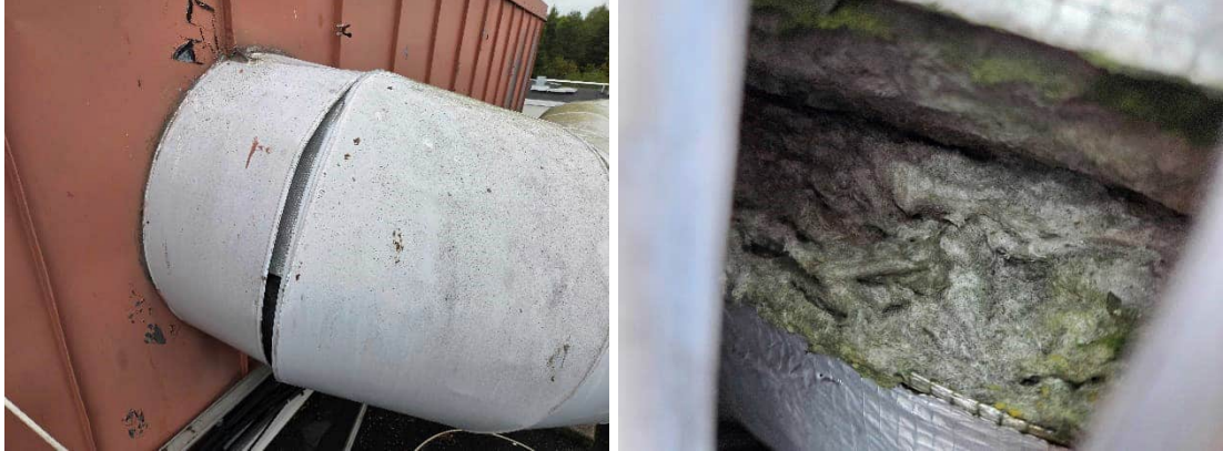
Kuvat 491 ja 492. IV-konehuoneeseen liittyvän IV-kanavan eristeen peltisuoja oli auennut liitoksestaan ja eristevillat olivat näkyvillä.
