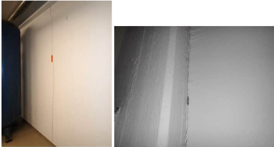
Kuvat 424 ja 425. Lämmönjakohuoneen D023 väliseinän halkeama sekä väliseinän ja pilarin liitos, jossa havaittiin ilmavirtauksiin viittaavaa mustumista.
