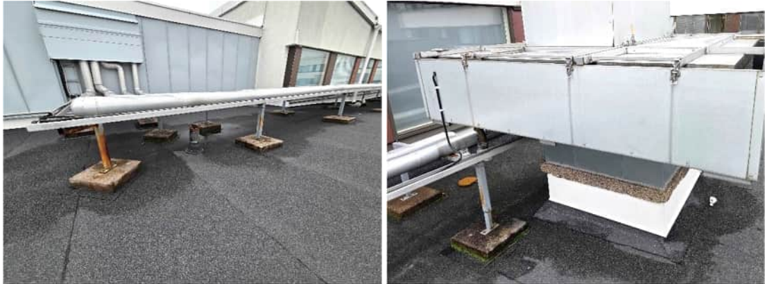
Kuvat 478 ja 479. Lämmöntalteenottokoneiden ja putkistojen tukijalkojen ympärillä oli paikoin jälkiä veden lammikoitumisesta. Vasemmanpuoleisen kuvan alueella vesikaton kaadot oli suunniteltu korjattavaksi edellisen vesikattoremontin yhteydessä.
