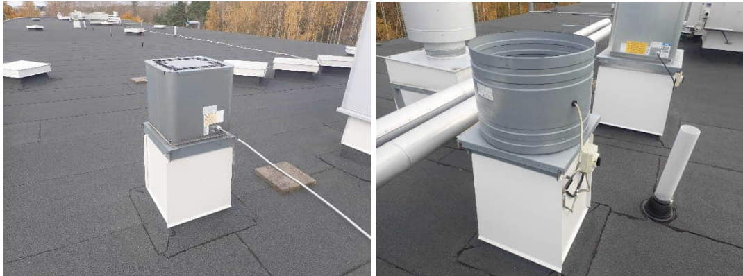
Kuvat 682 ja 683. Yleiskuvat erillispoistopuhaltimista (huippuimureista) D-osan vesikatolla. Puhaltimissa ei havaittu positiotunnuksia. Vasemman kuvan laite on vuodelta 2017 ja oikean kuvan laite vuodelta 2006, ja siinä havaittiin laakerivikaan viittaavaa käyntiääntä.
