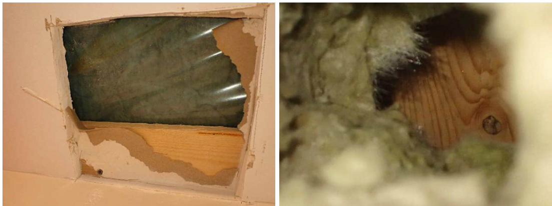
Kuvat 554 ja 555. Yhdyskäytävän C201 yläpohjan avaus R62. Höyrynsulkumuovissa havaittiin oranssi laikku ja yläpinnan vanerissa vähäistä tummentumaa.
