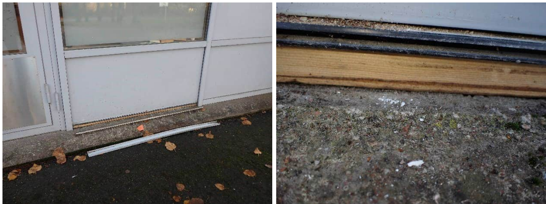
Kuvat 371 ja 372. Teknisentyön luokan D010 ulkoseinän avaus R75. Alareunan puurunko oli kiinni betonissa.
