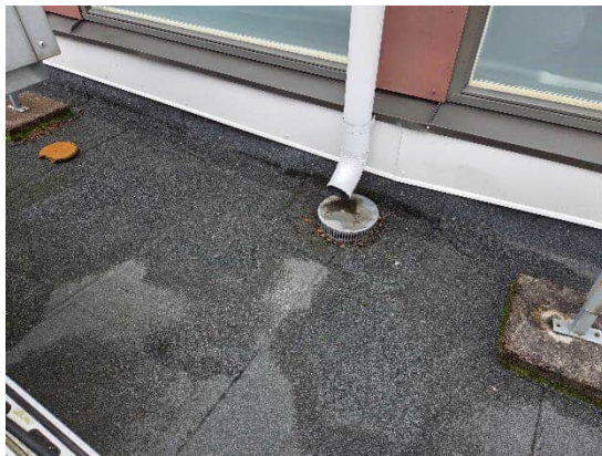
Kuva 480. Kattokaivojen roskasihdit olivat irrallisia. Kattokaivojen ympärillä oli paikoin jälkiä veden lammikoitumisesta ja sammalkasvustoa.
