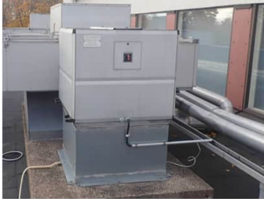
Kuva 639. Yleiskuva huippuimurista TK08PK1.
