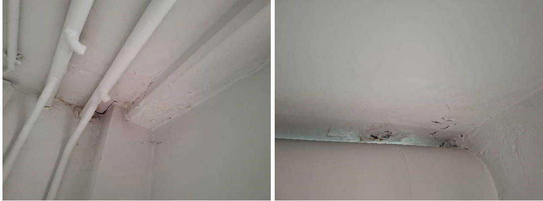
Kuvat 550 ja 551. Varaston D038 maalatun betonipintaisen katon kosteusjälkiä.
