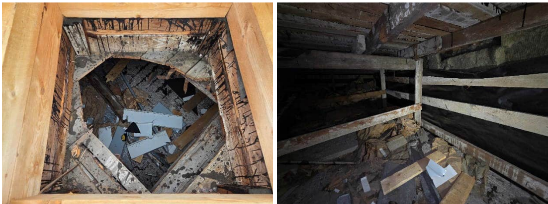
Kuvat 517 ja 518. Lounaispäädyn yläpohjatilassa havaittiin runsaasti rakennusjätettä.
