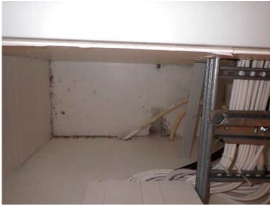
Kuva 226. Sähkökeskuksen katossa ja väliseinän yläosassa havaittiin mikrobikasvustoa.
