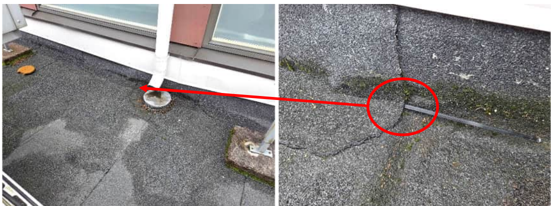
Kuvat 476 ja 477. Pintakermin limityskohta oli pieneltä osin irti alustastaan kattokaivon vierellä.
