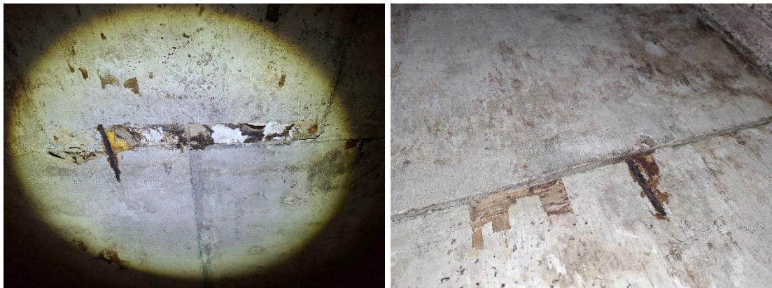
Kuvat 61 ja 62. Katossa oli muottilevyjen jäämiä ja pinnassa ruostuneita raudoituksia.
