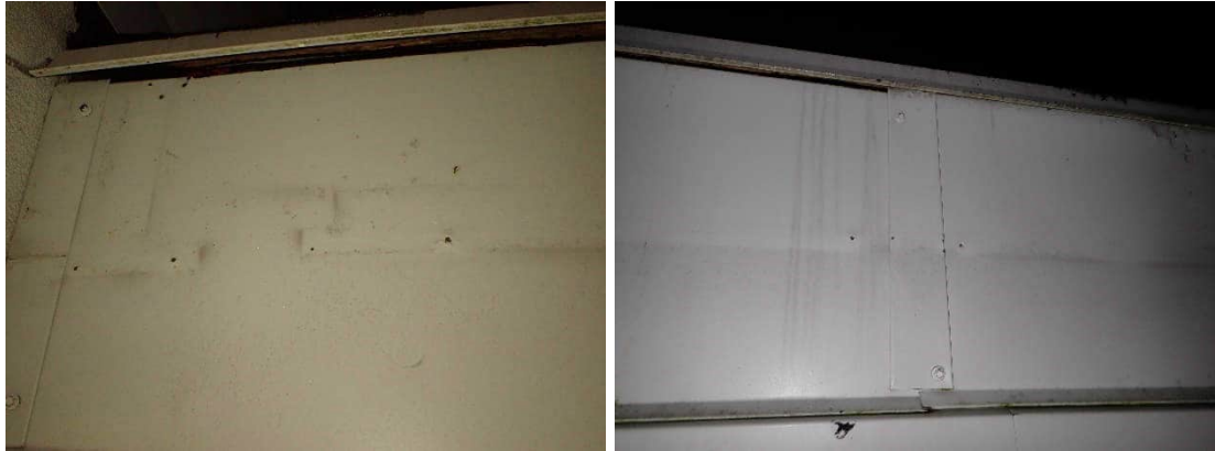
Kuvat 369 ja 370. Yhdyskäytävän C201 ulkoseinän yläosan pellityksessä on runsaasti vanhoja kiinnitysreikiä ja räystäspellin alla valumajälkiä.
