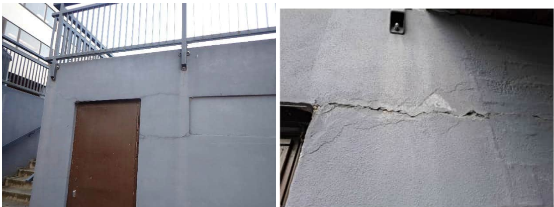
Kuvat 272 ja 273. Pihakannen alla sijaitsevien tilojen D038 ja 039 ulkoseinissä havaittiin halkeamia ja niissä paikoin kosteusjälkiä.
