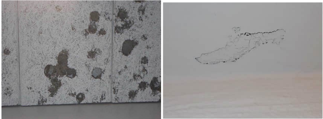
Kuvat 188 ja 189. Liikuntasalin A023 katon lastulevyt olivat paikoitellen isosti rikki. Väestönsuojan D040-D043 katossa oli musta kerros maalin alla.
