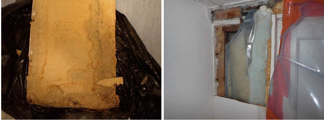
Kuvat 346 ja 347. Luokan A105 levyseinän avaus R42. Lastulevy oli kastunut ja ulkoseinän höyrynsulkumuovi oli hyvin epätiivis.
