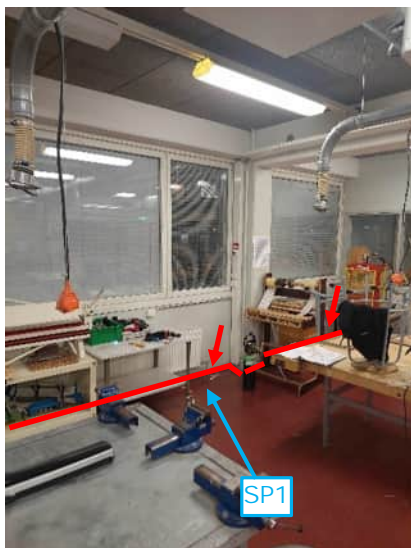
Kuva 236. Merkkiainekokeessa MA16 havaitut pistemäiset ilmavuotopaikat on merkitty punaisilla nuoleilla. Jatkuva vuotokohta on esitetty kuvassa punaisella viivalla. Kaasun syöttöpiste on merkitty sinisellä nuolella.
