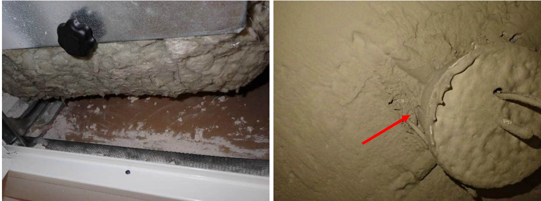
Kuvat 573 ja 574. Työhuoneen D219 yläpohjaan rajautuvan koteloinnin sisällä oli avointa mineraalivillaa ja kipsilevyn silppua. Keskeimmällä huonetta vanhan sähkörasian kohdalla yläpohjassa havaittiin lastuvillaeristettä (nuoli).
