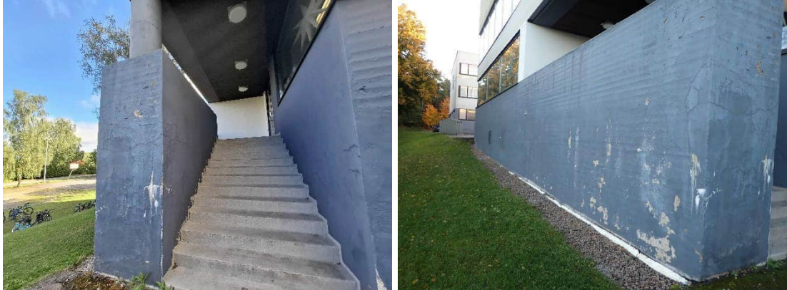
Kuvat 270 ja 271. Kuvaamataidon luokan B013 terassin ja ulkoportaiden muurissa oli kosteusjälkiä sekä betoni- ja maalipinnan lohkeilua.
