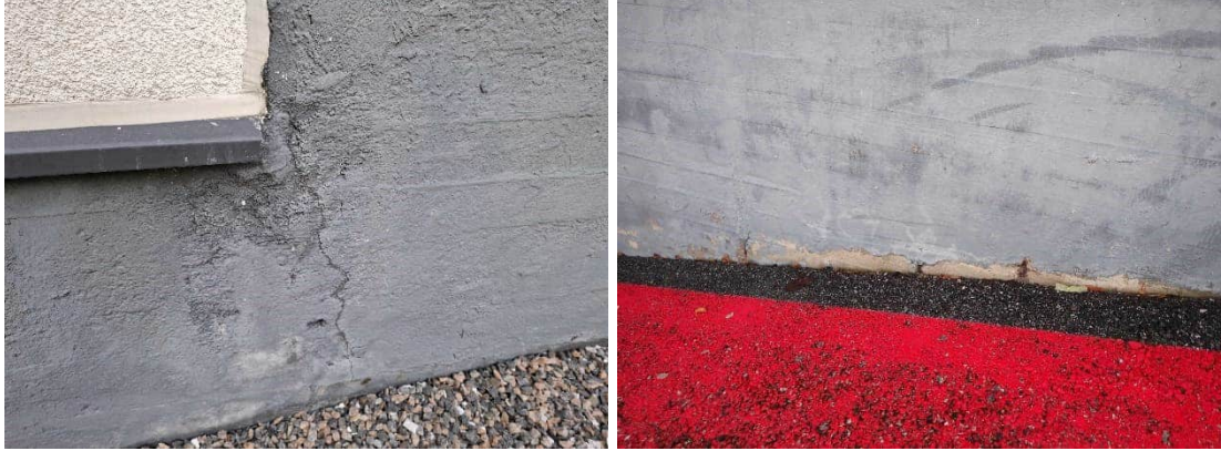
Kuvat 264 ja 265. Maalatuissa betonipinnoissa havaittiin paikoitellen halkeilua ja esiin tulleita ruostuneita raudoituksia. Kuvat ovat A-osan lounaissivulta.
