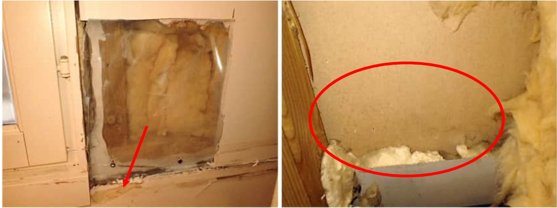
Kuvat 342 ja 343. Pukuhuoneen A008 ulkoseinän avaus R4. Ulkoseinäpinnassa havaittiin vanhoja kosteusjälkiä (nuoli) ja tuulensuojalevyn sisäpinnassa havaittiin hieman näkyvää mikrobikasvua (soikio).
