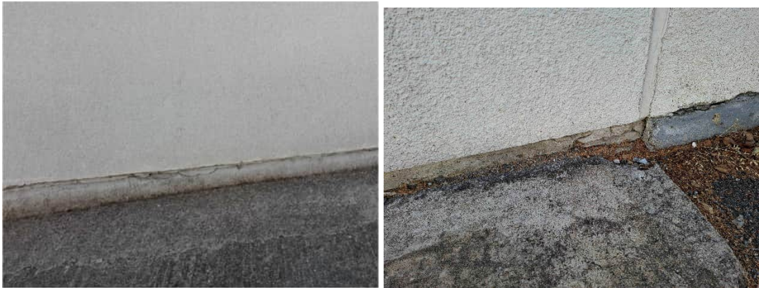
Kuvat 266 ja 267. Betonipinnan yläreunassa oli vaakahalkeamaa etenkin välituntipihan puolella. D-osan välituntipihan puolella maalatun betonin pintakerros oli irronnut paikoin kauttaaltaan.
