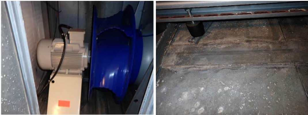
Kuvat 621 ja 622. Yleiskuvat tuloilmapuhaltimesta ja puhallinosan pohjalta. Puhallinosan pohjalla havaittiin vanhoja kosteusjälkiä.
