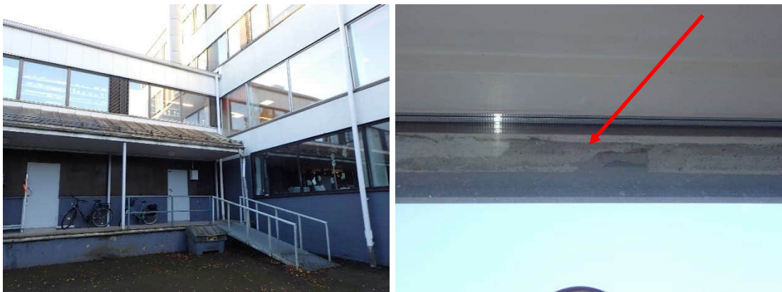
Kuvat 288 ja 289. Keittiön C109-C112 kohdalla julkisivussa on peltiverhousta. Ikkunan kohdalla peltiverhouksen takana havaittiin rapautunutta betonia (nuoli).
