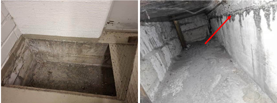
Kuvat 131 ja 132. Käytävän D022 alapohjan luukun avaus R36. Käytävän puoleisella seinämällä havaittiin sivelyä (nuoli).
