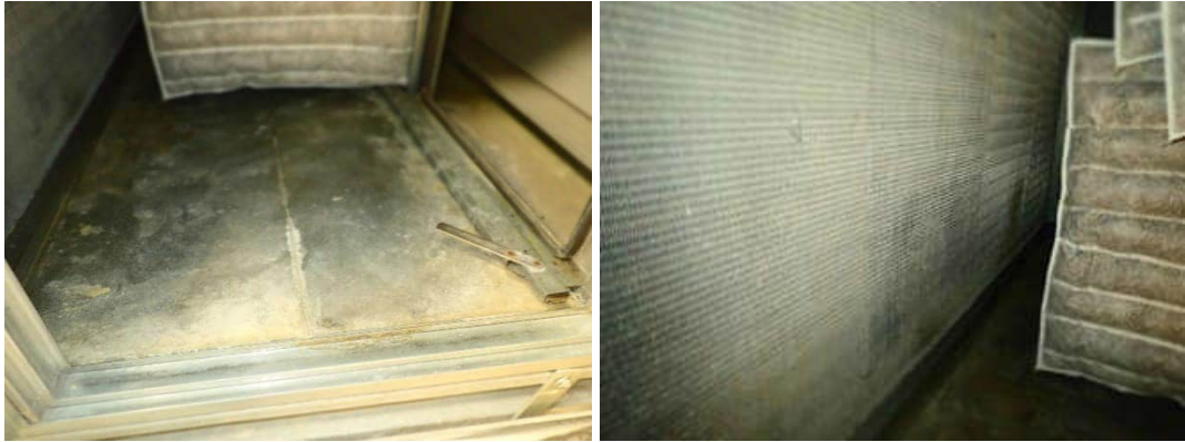
Kuvat 610 ja 611. Yleiskuvat tuloilmakoneen suodatinosasta ja LTO-patterista suodatinosan puolelta. Suodatinosan pohjalla havaittiin vanhoja kosteusjälkiä ja patterin pinnalla pölykertymä.
