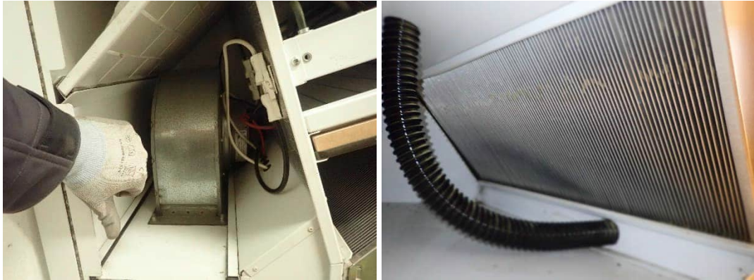
Kuvat 676 ja 677. Yleiskuvat tuloilmapuhaltimesta ja LTO-kennosta. Tuloilmapuhaltimen havaittiin olevan laakerivikainen, eikä se tuottanut juurikaan ilmavirtaa. LTO-kennon havaittiin olevan hieman likainen.
