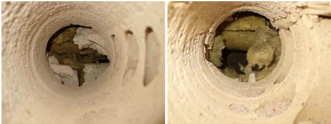
Kuvat 340 ja 341. Kuvaamataidon luokan B013 ulkoseinäavauksen R23 alareunassa havaittiin mineraalivillan lisäksi EPS-eristettä rakenteen ulkopinnassa. Kummassakin luokan avauskohdassa seinän eristetilassa havaittiin putkieristettä, oikeanpuoleinen kuva avauksesta R24.
