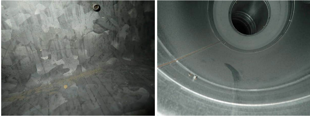
Kuvat 707 ja 708. Yleiskuvat poistoilmakanavien sisältä. Vasen kuva on B-osan poistoilman kokoojakanavasta ja oikean puolen kuva D-osalta poistoilmalaitteen kytkentäkanavasta. Kanavissa oli hieman likaa.
