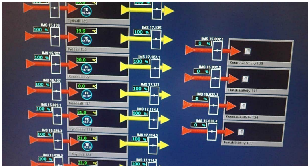
Kuva 716. Yleiskuva ilmanvaihtokoneen TK07 ilmamääräsäätimien grafiikasta. Kuuma- ja pintakäsitteilytiloja lukuun ottamatta tulo- ja poistoilman ilmamääräsäätimet olivat ohjattuina täydelle ilmavirtaukselle (100 %).
