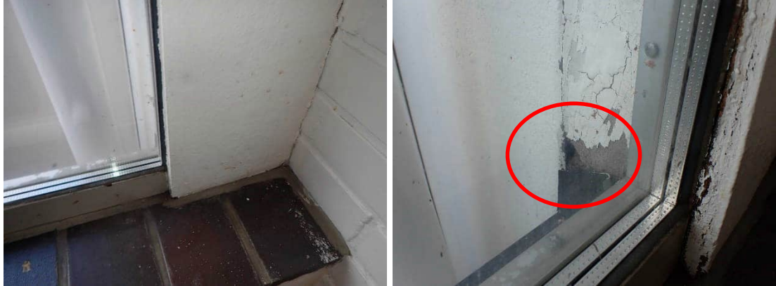
Kuvat 355 ja 356. Ruokalan B103 ulkoseinän levytetyissä kohdissa todettiin lastulevyn kupruamista kosteuden seurauksena. Ulkopuolella keittiön ulkoseinässä on merkittävää epätiiveyttä ikkunan vesipelin liittymän kohdalla (ympyrä).
