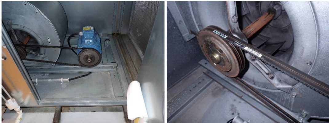
Kuvat 579 ja 580. Yleiskuvat tuloilmapuhaltimesta. Puhallin oli puhdas, mutta hihnapyörät olivat hieman kuluneet.
