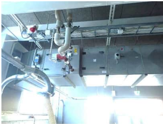
Kuva 646. Yleiskuva TK10 tuloilmakoneesta. Iv-kone sijoittuu haasteellisesti teknisen tilan työtölkoneiden päälle, minkä lisäksi puhaltimen huoltoluukku oli jumiutunut. Puhaltimen kuntoa ei iv-koneen osalta saatu tarkastettua, mutta se piti täydellä käyntiteholla voimakasta vikaantumiseen viittaavaa käyntiääntä.
