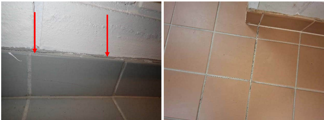
Kuvat 152 ja 153. Halkeamia keraamisen laatoituksen ylösnostossa musiikkiluokassa A043 ja laatta-saumoissa aulassa B005.
