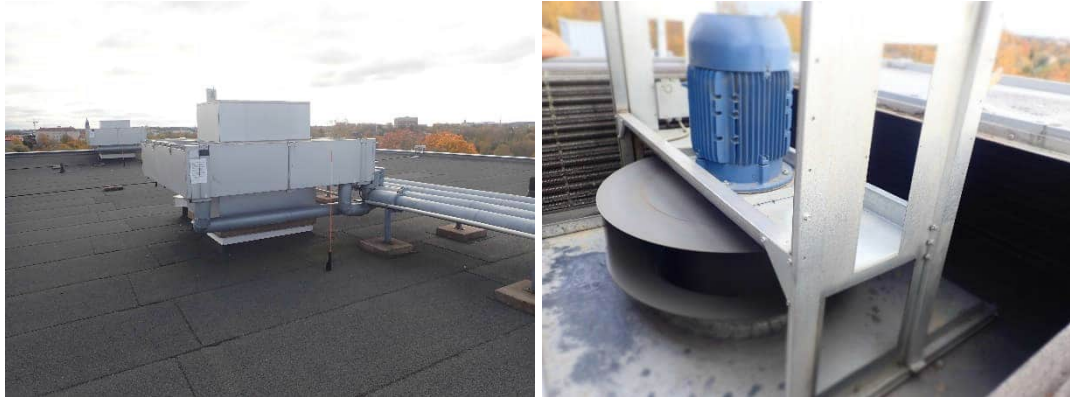
Kuvat 606 ja 607. Yleiskuvat poistoilmakoneesta TK04PK02 ulkopuolelta ja sisäpuolelta (toinen TK04 PK01 on vastaavanlainen). Puhaltimien havaittiin hieman vapisevan käynnin aikana, mutta poikkeavia käyntiäänä ei havaittu. Neulapatterit olivat silmämääräisten havaintojen perusteella puhtaat. LTO-putkistojen eristeiden suojapellityksissä havaittiin paikoin puutteita.
