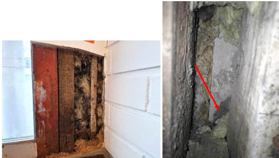
Kuvat 357 ja 358. Ruokalan B103 ulkoseinän avaus R72. Keittiön ulkoseinän sisäkuoressa havaittiin viitteitä kastumisesta (nuoli).
