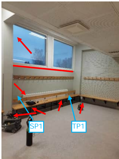
Kuva 373. Merkkiainekokeessa MA20 havaitut pistemäiset ilmavuotopaikat ennen jalkalistan raottamista on merkitty punaisilla nuolilla. Jatkuvat vuodot on merkitty punaisella viivalla. Kaasun syöttöpiste (SP) ja tarkastuspiste (TP) on merkitty sinisillä nuolilla.
