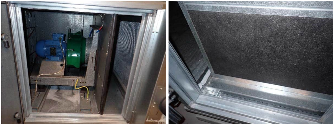
Kuvat 654 ja 655. Yleiskuva tuloilmapuhaltimesta ja äänenvaimennuselementeistä tuloilmapuolelta. Puhallin ja äänenvaimennusosat olivat hyväkuntoiset. Vastaavat havainnot tehtiin poistoilmapuolelta.
