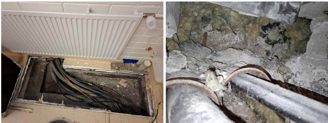
Kuvat 133 ja 134. Luokan D012 alapohjan luukun avaus R35. Sähköjohtojen ulkoseinäläpiviennin päältä puuttuu tiili ja seinän lämmöneristeet ovat näkyvillä.
