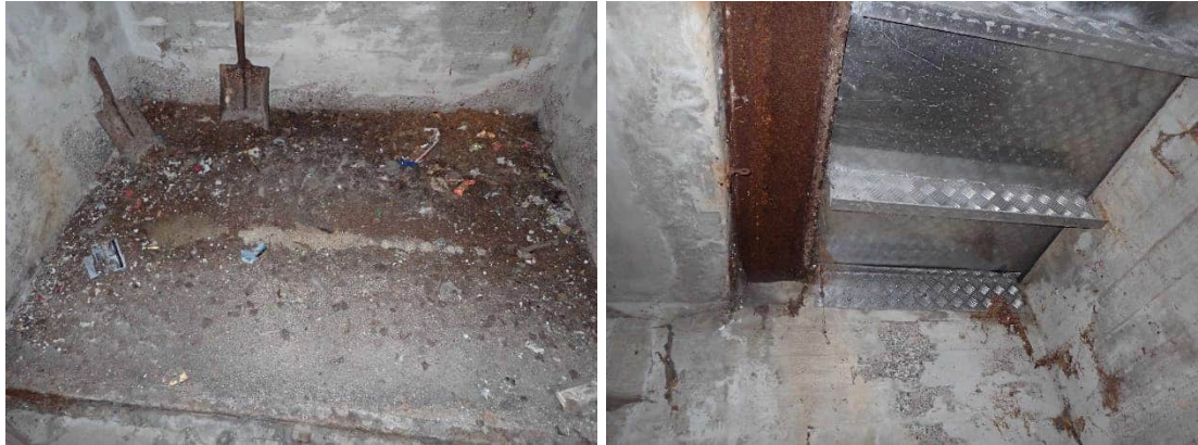
Kuvat 401 ja 402. Puuvien takana on betonipintainen syvennys, jonka katossa on teräspalkki ja peltilevytys. Pohjalla oli runsaasti lehtiä ja roskaa, katon palkki oli ruosteessa.
