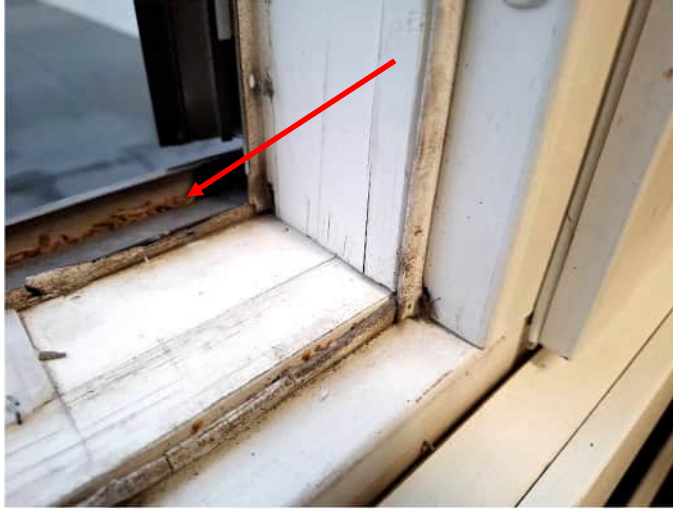
Kuva 384. Ikkunoiden lasiväljen maalipinnoissa havaittiin pientä hilseilyä ja puun halkeilua. Sisä- ja ulkopuolen tiivisteet olivat paikoin heikossa kunnossa, ja vedenpoistouraani oli kertynyt roskaa (nuoli).
