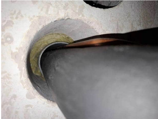
Kuva 223. Pukuhuoneen C003 alakaton avauksen R81 takana oli mineraalivillaa välipohjan putkiläpiviennissä.
