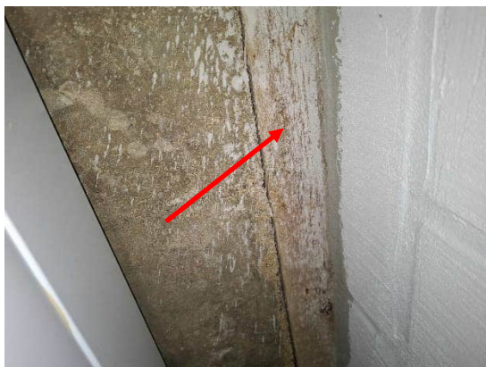
Kuva 206. Keittiössä C001 havaittiin välipohjan alapinnassa puuta kylmiön ja väliseinän välissä.
