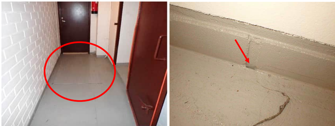
Kuvat 148 ja 149. Kellarikäytävien A001a-A001c alapohjan luukkujen reunoilta (soikio) ja väliseinä- liittymien raoista (nuoli) todettiin ilmapuotoa käytävän suuntaan.
