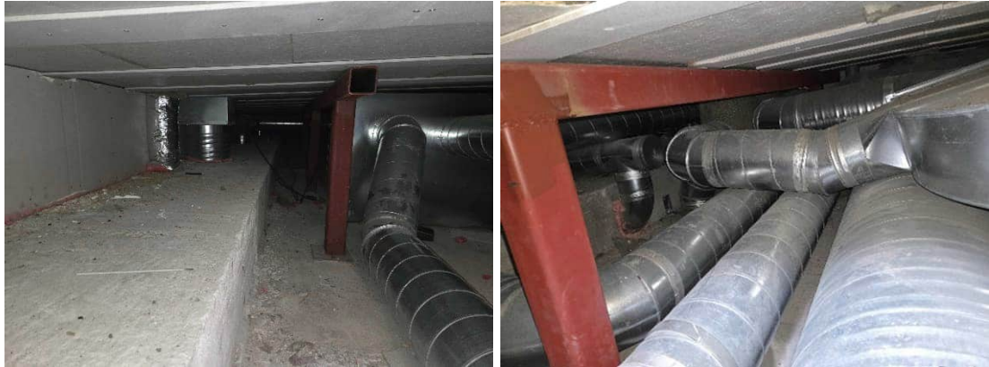
Kuvat 540 ja 541. D-osan yläpohjatilan keskellä on levytetty talotekniikkakotelointi, jossa on IV-kanavia.
