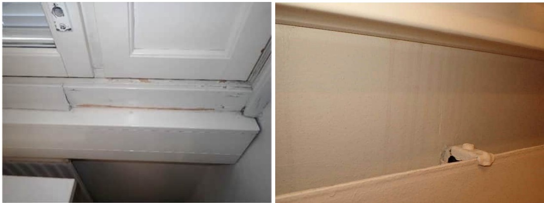
Kuvat 317 ja 318. Luokan D206 ikkunan alalistan maalipinta hilseilee tuuletusikkunan alla ja luokan B213 ikkunan alla seinäpinnassa on valumajälkiä.
