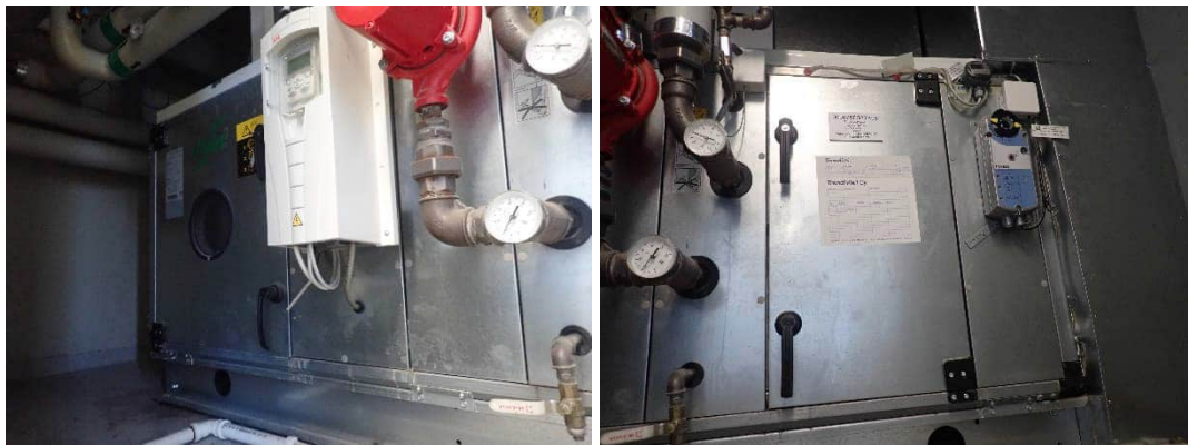
Kuvat 625 ja 626. Yleiskuvat TK07 tulo- ja poistoilmakoneista. Tuloilmakoneen ulkoilmakammion alla havaittiin vanhoja kosteusjälkiä ja poistoilmakoneen osalta havaittiin sulkupellin olevan kanaviston puolella, kun sen kuuluisi olla ulospuhalluspuolella.
