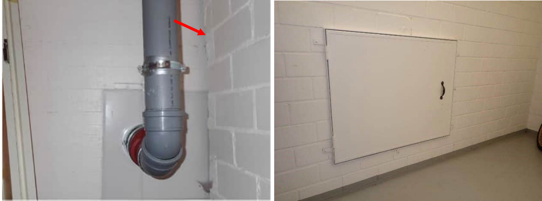
Kuvat 136 ja 137. A-osan alustatilasta todettiin ilmavuotoa käytävän A051 perällä olevaan putkikomeroon läpiviennin ja tiilikuorimuurauksen taustan (nuoli) kautta. Ilmavuotoa käytävälle A051 todettiin alustatilan toisen kulkuluukun reunoilta.
