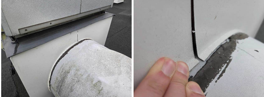
Kuvat 495 ja 496. Yksittäisen ilmanvaihtokoneen suojaPELLITYKSESSÄ havaittiin epätiivis, limittämätön sauma ja kanavan tiivistysmassaus oli haurastunut.
