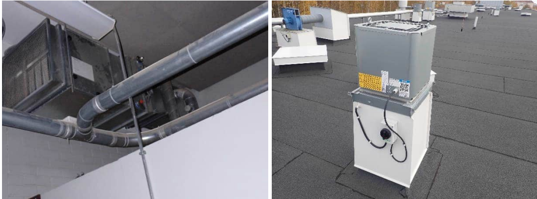
Kuvat 649 ja 650. Yleiskuva poistoilman suodatin- ja sulkupeltiosasta opetustilan puolella ja huippuimurista TK10PK1 vesikatolla. Huippuimuri oli valmistajan merkinnän mukaan vuodelta 2024.
