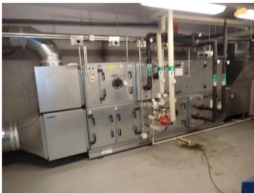
Kuva 651. Yleiskuva ilmanvaihtokoneesta TK11.
