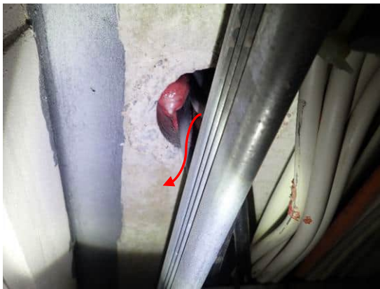
Kuvat 10, 11 ja 12 . Yläpohjarakenteissa havaittiin yksittäisiä avoimia läpivientejä, joissa havaittiin ilmavirtausta sisätiloihin päin.
