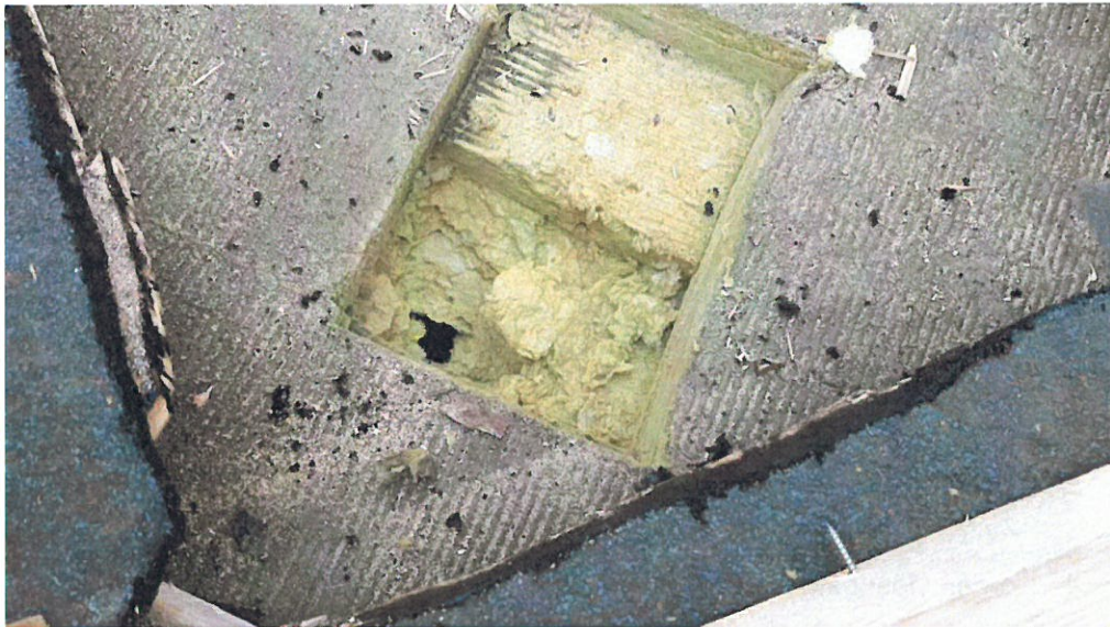
6. Ylimmän kattotason (liikuntahalli) kautta tarkasteltiin katon rakennekerroksia. Liikuntasalin katon osalla ei ole höyry- tai ilmansulkua. Katto on ns. ylipainekatto, jossa ilman virtaus tapahtuu lämmöneristekerroksen lävitse ulkoa sisälle.
