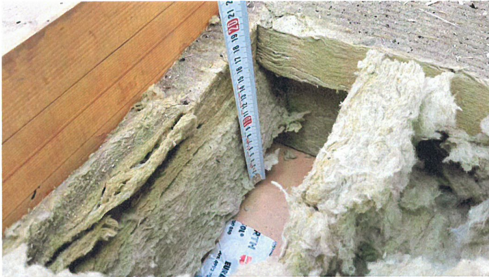
5. Alemman kattotason (uimahalli) luukusta tarkasteltaessa ei havaittu kosteusvaurioita. Liimapuupalkit ovat tarkastelluilta osin hyväkuntoiset. Villojen poistovaiheessa puhkaistiin reikä alumiinipaperiin, joka paikattiin höyrysulkuteipillä.
