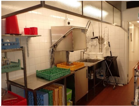
Kuva 100. Keittiön C17 tiskipisteen kohdalla todettiin viitteellisessä pintakosteuskartoituksessa selkeästi koholla olevia arvoja seinän alaosassa.
