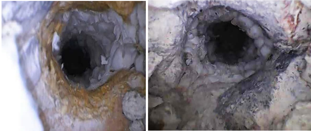
Kuvat 15 ja 16. Alapohjarakenne porauksista P1 ja P2. Porauksessa P1 betonilaatan ja eristeen välissä ruskea kerros noin 15 mm ja porauksessa P2 rikkonaisempaa betonia alimmat 15 mm.
