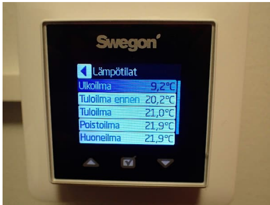
Kuva 162. Yleiskuva iv-koneen TK03 käyttöpaneelin lämpötilamittauksista.
