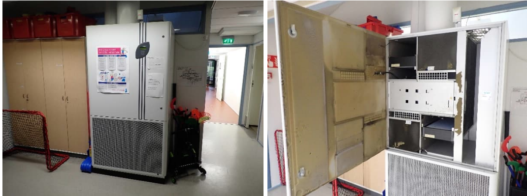
Kuvat 157 ja 158. Yleiskuvia paikallisesta ilmanvaihtokoneesta TK02. Kone on silmämääräisten havaintojen perusteella siisti ja hyväkuntoinen.
