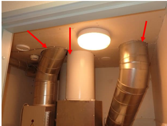
Kuva 132. Ilmanvaihtokonehuoneen B208 kattoläpivienneistä virtasi ilmaa (nuolet).
