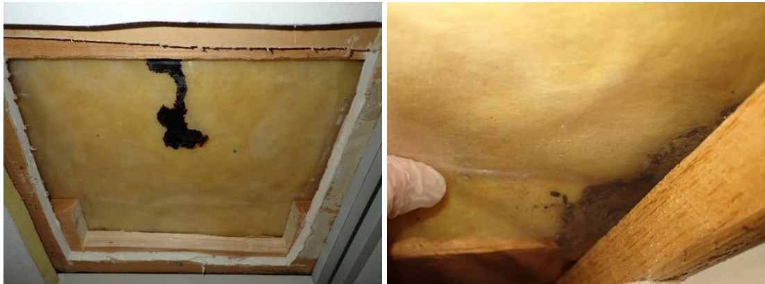
Kuvat 135 ja 136. Avaus R25 ryhmähuoneeseen B105a sisäkatossa ulkoseinän vierellä. Höyrynsulkumuovin päällä oli runsaasti hiiren ulostetta ja tummaa valumaa, jota valui myös ulkoseinän palkille.
