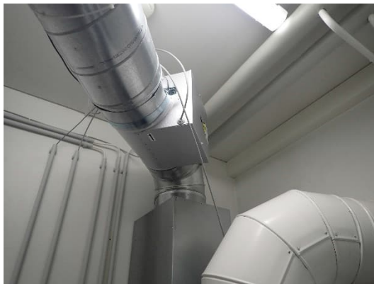
Kuva 165. Yleiskuva ilmanvaihtokoneen TK04 sähkötoimisesta jälkilämmityspatterista.
