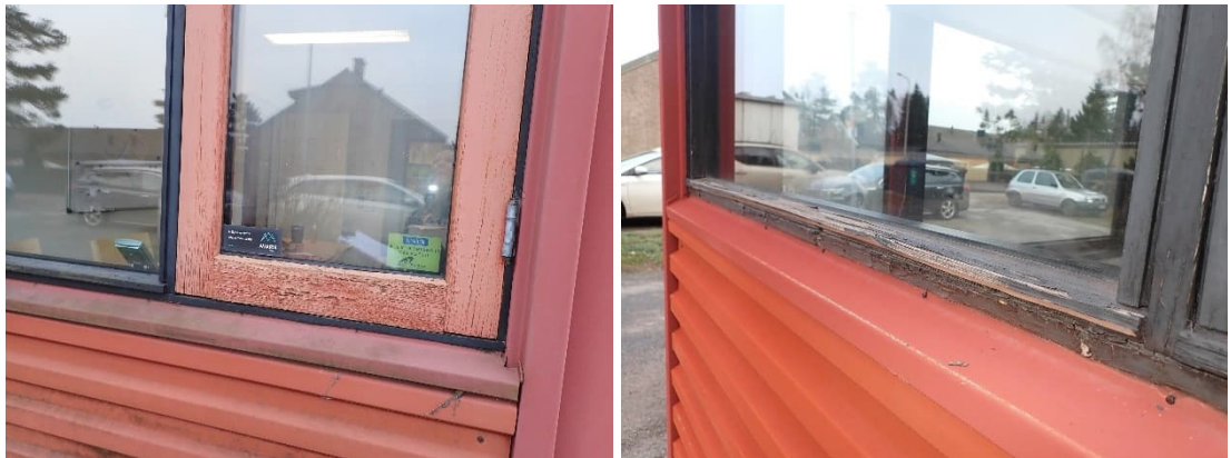
Kuvat 86 ja 87. Ikkunoiden maalipinnat ovat alaosista heikkokuntoista ja etenkin länsi- ja eteläsiivillä myös puuaines on haristunut.
