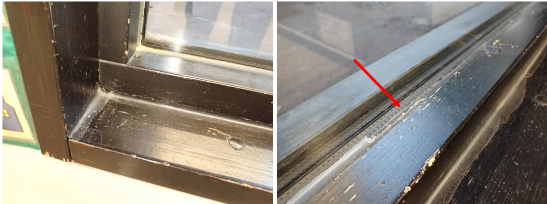
Kuvat 90 ja 91. Ikkunoiden alaosien liittymiä on massattu huonetiloihin. Huoneen B106 kohdalla todettiin puutteita sisäpuolen lasituskittauksessa (nuoli).
