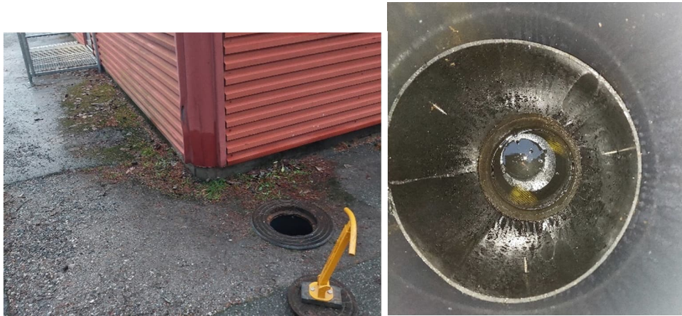
Kuvat 10 ja 11. Länsipäädyssä keittiön C17 kohdalla sijaitsevan salaojakaivon vedenpinnan todettiin olevan salaojaputkien yläpuolella.
