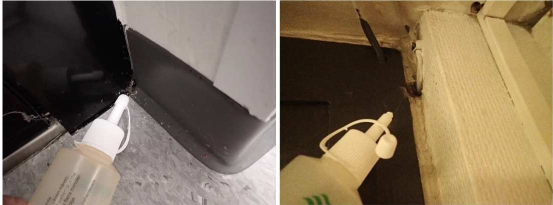
Kuvat 84 ja 85. Ryhmätalon C19 uuden oven liittymistä todettiin ilmavirtausta huonetilaan. Muuten oviliittymistä todettiin lähinnä paikallisia vuotoja, kuten sähköjohtojen läpiviennit.
