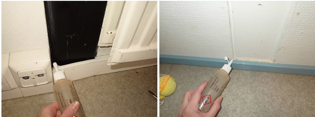
Kuvat 37 ja 38. Merkkisavun avulla todettiin il-mavuotoa pääosin ulkoseinällä olevien liimapuupilareiden alaosien liittymistä. Paikoitellen il-mavuotoa todettiin myös väliseinällä olevien pilareiden alaosien liittymistä (oikeanpuoleinen kuva).
