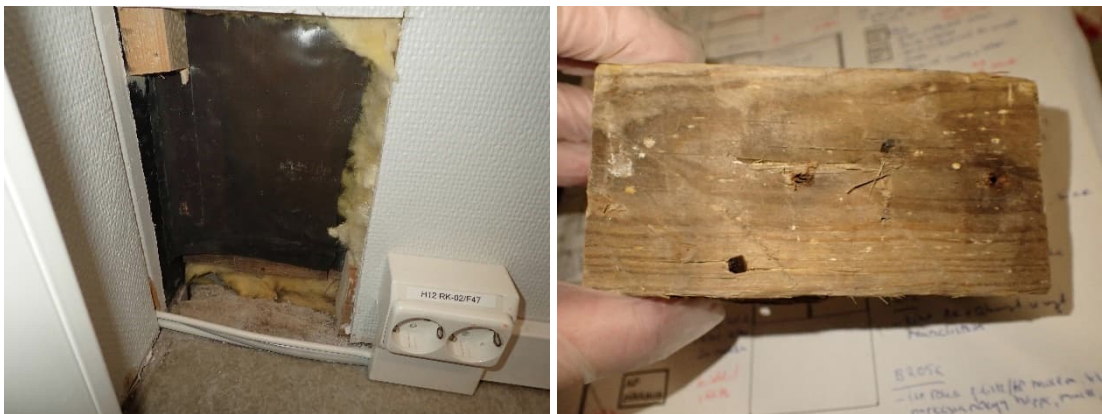
Kuvat 74 ja 75. Ryhmähuoneen B205b ulkoseinän alareunan avaus R21. Alajuoksuin etupinnassa havaittiin näkyvää mikrobikasvua.
