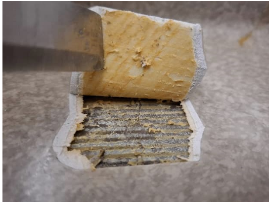
Kuva 23. Wc-tilan C09 viiltomittaus MP1. Mittapisteessä MP1 suhteellinen kosteus oli korkea muovimaton alla ja maton alla havaittiin mikrobiperäistä hajua ja poikkeavaa kemiallista hajua.
