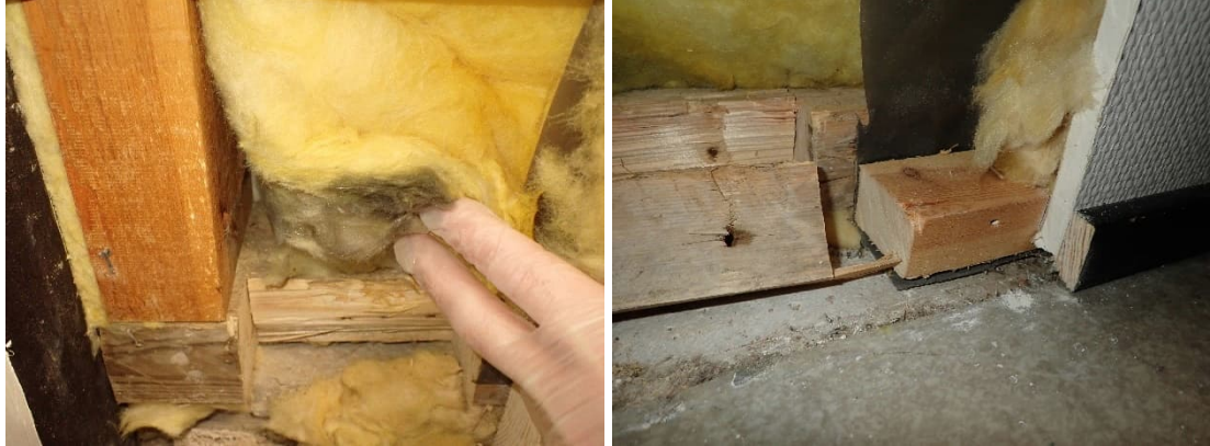
Kuvat 62 ja 63. Ulkoseinien lämmöneristeissä havaittiin ilmapuotoihin viittaavaa mustumista. Höyryn-sulkumuoveja ei ole liitetty tiiviisti viereisiin rakenteisiin, vaan ne on taitettu koolausten alle.
