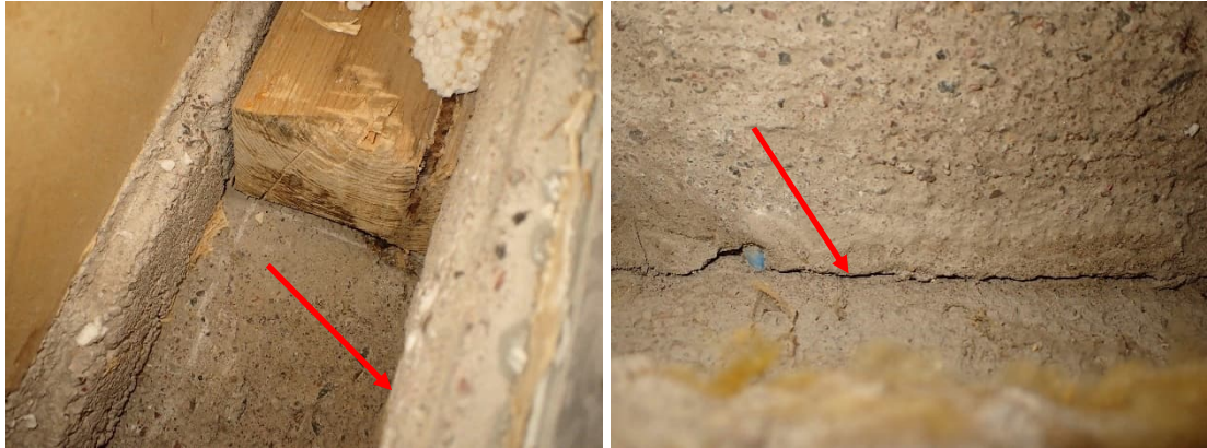
Kuvat 105 ja 106. Ryhmätilan C19 väliseinän alaosaan tehtiin rakenneavaus R10. Seinän alajuoksu lähti alapohjan eristetilan alapinnan tasolta oman anturan päältä. Huoneen C19 alapohjan ja väliseinän kolon rajakohdassa oli rako (nuolet), josta todettiin ilmavirtausta huoneen suuntaan.
