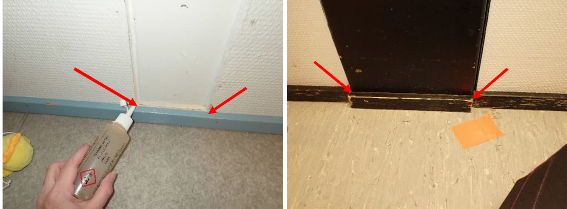
Kuvat 113 ja 114. Väliseinien liimapuupilareiden alapohjaliittymistä todettiin useassa kohdissa ilmavirtausta huonetilan suuntaan, myös kohdissa, joissa jalkalistojen yläreunoja oli massattu.
