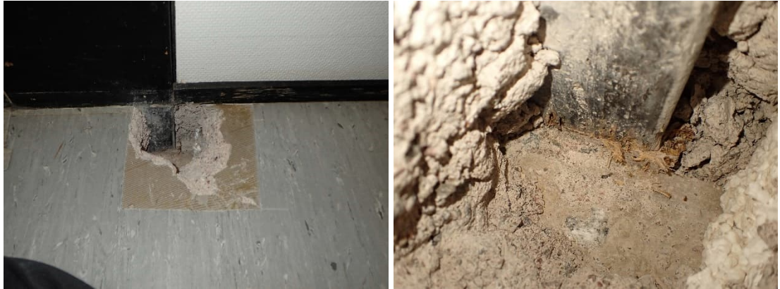
Kuvat 109 ja 110. Väliseinän pilarin alareuna käytävän C02 avauksessa R30. Pilari ja sen alla oleva vaneri olivat pehmentyneet ja avauksessa oli mikrobiperäistä hajua.
