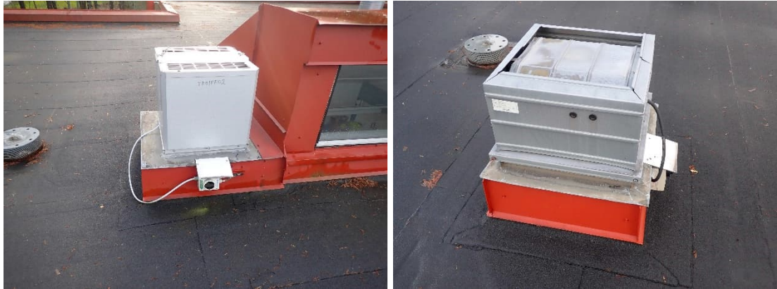
Kuvat 166 ja 167. Yleiskuvia huippuimureista. Vasemmassa kuvassa on TK01PF02 ja oikeassa kuvassa on TK01PF05.
