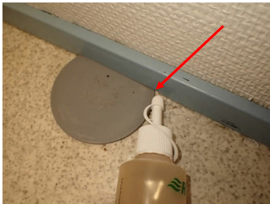
Kuva 115. Toimistohuoneesta C24 on poistettu lavuaari ja sen viemäri on tulpattu. Tulppauksen ja väliseinän välistä todettiin ilmavirtausta huoneen suuntaan.
