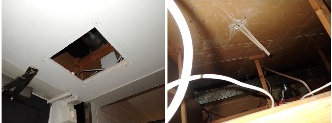
Kuvat 148 ja 149. Tuulikaapin A01 alakaton luukun avaus R24. Sähköläpivientejä ei yletytty tarkastamaan merkkisavulla, mutta toisen avauksen kohdalla todettiin, että sähköjohdot kulkevat höyrynsulun alapuolella eivätkä läpäise sitä.
