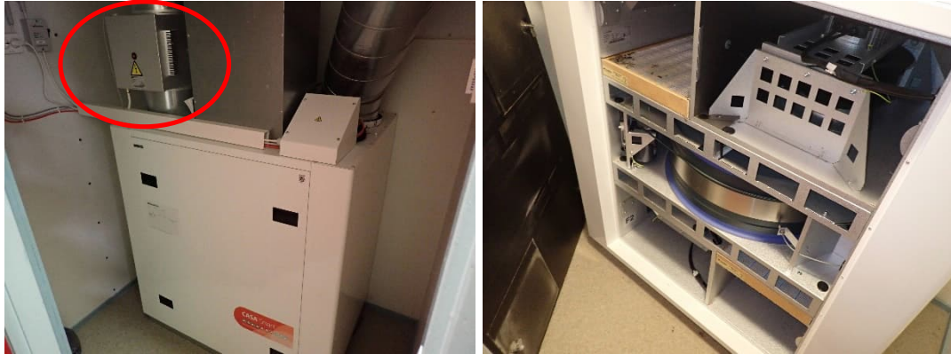
Kuvat 160 ja 161. Yleiskuvat paikallisesta ilmanvaihdonkoneesta TK03. Kone on silmämääräisten havaintojen perusteella siisti ja hyväkuntoinen. Vasemmassa kuvassa näkyy kanavassa sähkötoiminen jälkilämmityspatteri (ympyrä).
