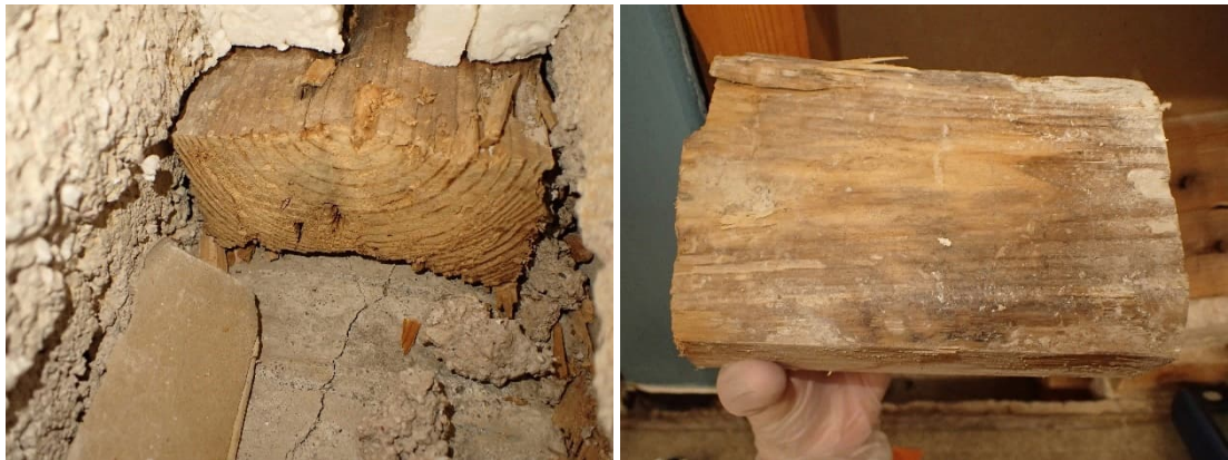
Kuvat 107 ja 108. Monitoimitilan C25 väliseinän avaus R20. Alajuoksu oli lahonnut ja sen alapinnassa oli näkyvää mikrobikasvua.
