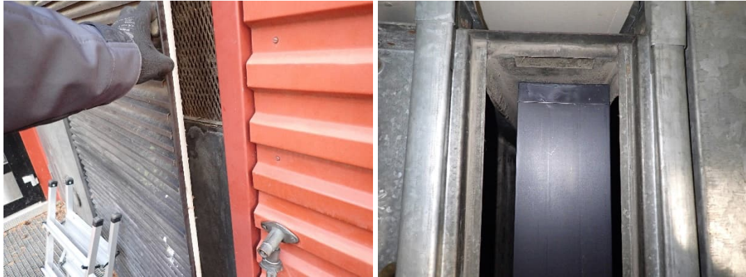
Kuvat 155 ja 156. Rakennuksen ulkoseinässä olevan tuloilmakoneen TK01 ulkoilmasäleikön havaittiin olevan osin irti kehyksestä. Lisäksi paneelimallisten tuloilmasuodattimien havaittiin olevan vääräkokoisia suodatinosaan. Koneen sisällä havaittiin likaa ja kosteusjälkiä.
