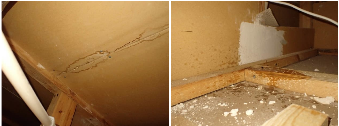
Kuvat 150 ja 151. Wc-tilan C10 kohdalla todettiin vesivuoto yläpohjassa. Kuvat ovat avauksesta R31.
