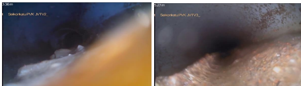
Kuva 187 ja 188. Vasemmassa kuvassa (JVTV2) viemärihajotuksen tukkeumaa / kertymää. Oikeassa kuvassa (JVTV3) viemäriinlinjassa runsaasti hiekkaa.
