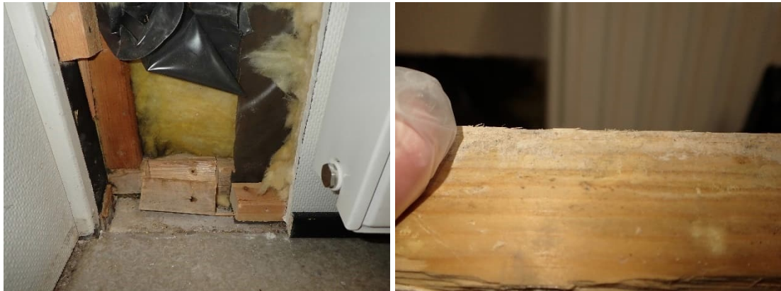
Kuvat 66 ja 67. Ryhmähuoneen A06 ulkoseinän alaosan avaus R3. Alajuoksun alapinnassa todettiin mikrobikasvua.
