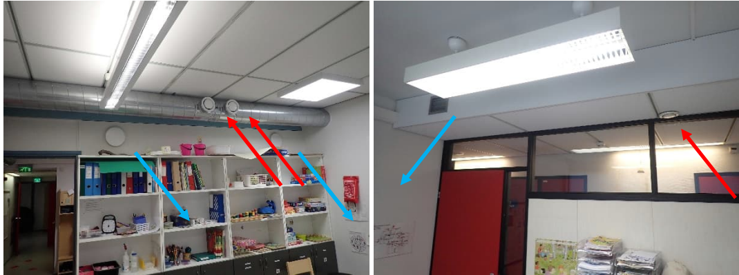
Kuvat 181 ja 182. Yleiskuvia tilojen ilmajaoista. Vasemmassa kuvassa on 2023 vuoden ilmanvaihto-asennuksista tilassa B105b (ryhmätila) ja oikeassa kuvassa on alkuperäisiä ilmanvaihtoasennuksia tilassa C03 (toimisto). Siniset nuolet kuvastavat suuntaa antavasti tuloilmavirtauksia ja punaiset nuolet poistoilmavirtauksia.
