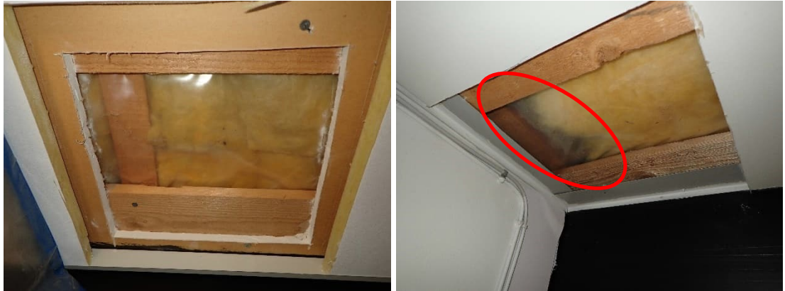
Kuvat 137 ja 138. Ryhmähuoneen A06 yläpohjan avaus R26 ja henkilökunnan taukotilan C05 yläpohjan avaus R27. Avauksessa R27 on lämmöneristeessä ilmavirtauksiin viittaavaa mustumista.
