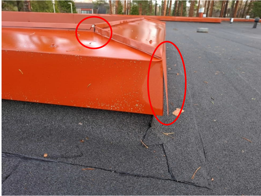
Kuva 123. Räystäiden pellitysten liittymissä havaittiin yksittäisiä puutteita ja huolimattomuutta.
