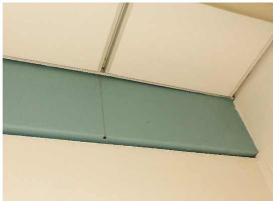
Kuva 61. Ryhmähuoneen B105a ulkoseinän yläosan palkin ruskea valumajälki.
