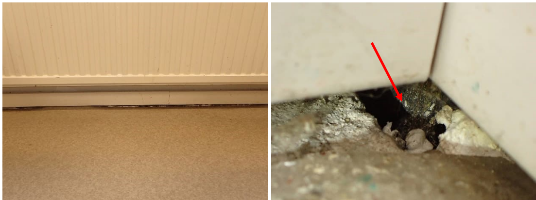
Kuvat 39 ja 40. Ryhmähuoneen B205a kohdalla alapohjan ja ulkoseinien liittymässä on iso rako, josta näkyy EPS-eristettä. Oikeanpuoleisessa kuvassa näkyy EPS-eristeen lisäksi huoneen ulkonurkassa oleva ulkoseinän puupilari, joka lähtee alapohjan sisäältä (nuoli).
