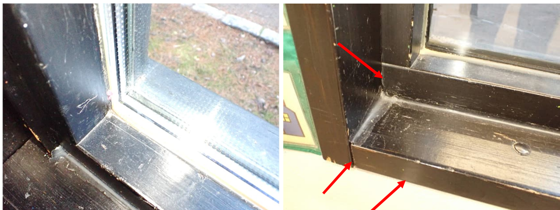
Kuvat 82 ja 83. Ikkunoiden alareunojen liittymiä oli massattu useassa tilassa. Ikkunoiden liittymistä todettiin ilmavuotoja, ikkunapenkkien alta todettiin myös paikoin ilmavuotoa (nuolet).
