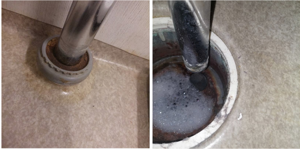
Kuva 183 ja 184. Kuva kovettuneesta käsienvesualtaan viemäröinnin tiivisteestä vasemmalla. Käsienvesualtaan hajulukon purkuputki oli jätetty kaivon vedenpinnan yläpuolelle.
