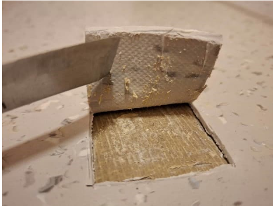
Kuva 28. Wc-tilan B203 mittapiste MP6. Suhteellinen kosteus oli koholla muovimaton alla. Muovimaton alla ei havaittu poikkeavaa hajua.
