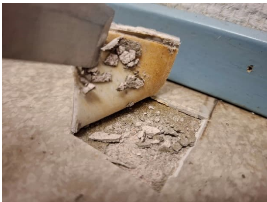
Kuvat 29, 30 ja 31. Eteisen B204 mittapisteen MP7, MP8 ja MP9. Mittapisteen MP7 kohdalla todettiin koholla olevaa suhteellista kosteutta muovimaton alla, muiden mittapisteen kohdalla suhteellinen kosteus oli tavanomainen. Muovimaton alla ei havaittu poikkeavaa hajua yhdessäkään mittapisteessä.
