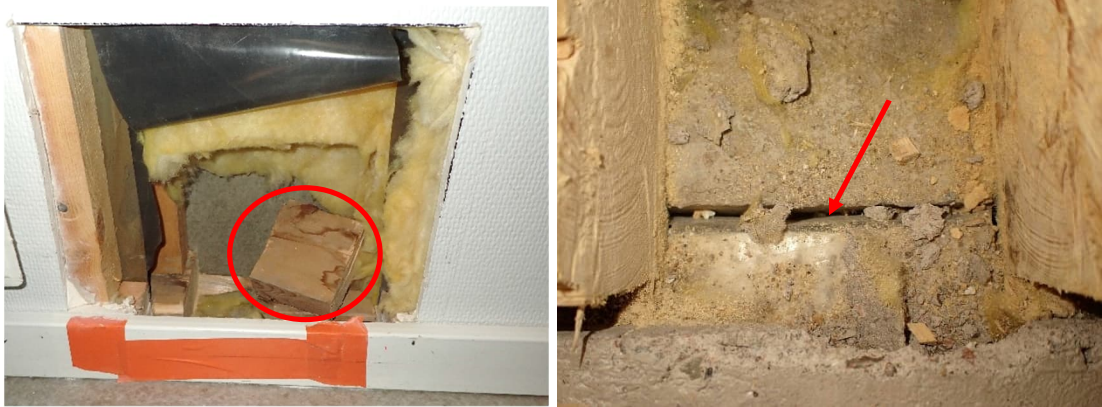
Kuvat 72 ja 73. Ryhmähuoneen B106 ulkoseinän alareunan avaus R16. Alajuoksun yläpinnassa oli kosteusjälkiä (ympyrä). Sokkelin ja EPS-eristeen välissä oli iso rako (nuoli).
