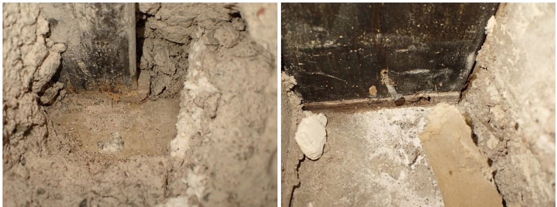
Kuvat 34 ja 35. Käytävän C02 alapohjan avaus R30 ja monitoimitilan C25 väliseinän avaus R20. Alapohjan eristeen alla ja väliseinän alajuoksun alla näkyy anturan betonia. Betonissa todettiin koholla olevia arvoja pintakosteusilmaisimella.
