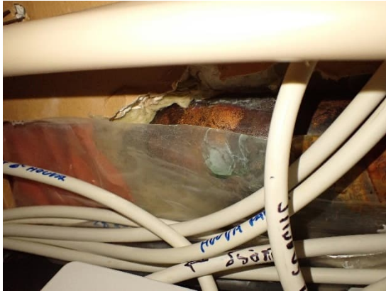
Kuva 141. Ryhmätilan C19 alakaton avauskohdan R13 kondensoiva kattovesiviemäri.
