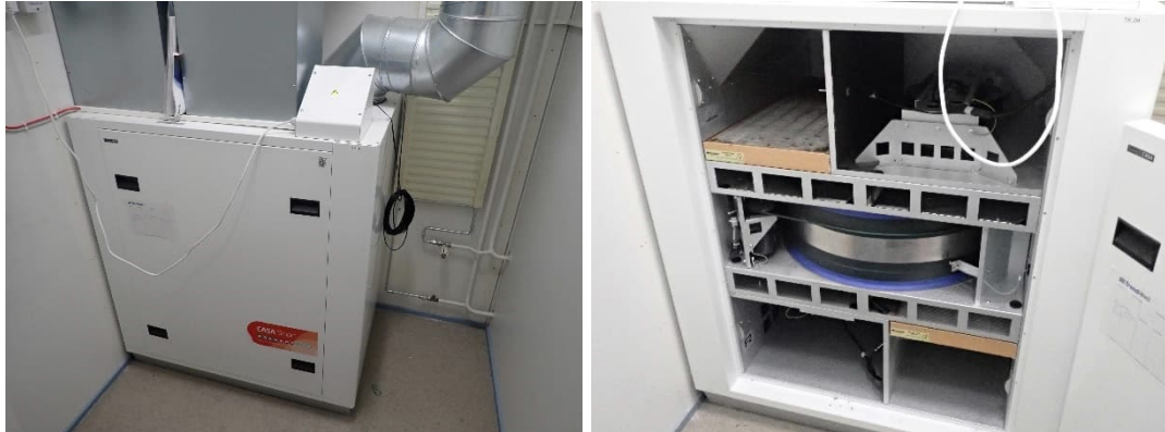
Kuvat 163 ja 164. Yleiskuvat paikallisesta ilmanvaihtokoneesta TK04. Kone on silmämääräisten havaintojen perusteella siisti ja hyväkuntoinen.
