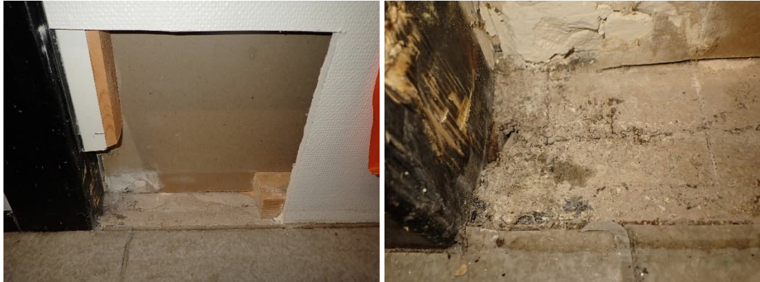
Kuvat 101 ja 102. Ryhmähuoneen A06 väliseinän avaus R5. Väliseinän alajuoksu lähtee alapohjan päältä, liimapuupilari jatkuu alapohjan sisään. Pilarin liittymässä havaittiin mikrobiperäistä hajua.
