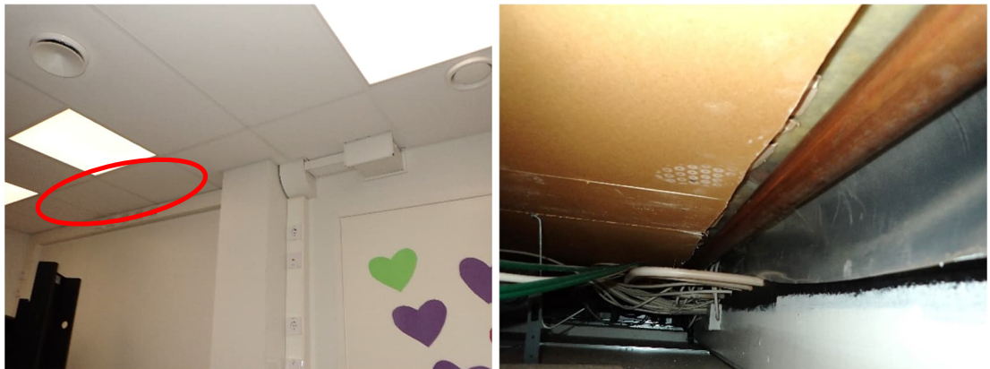
Kuvat 139 ja 140. Ryhmätilan C19 alakaton avauskohta R13 väliseinän vierellä. Alakaton takana ja yläpohjassa oli ainakin osin eristämätön kuparinen kattovesiviemäri, joka kondensoi tarkastushetkellä.
