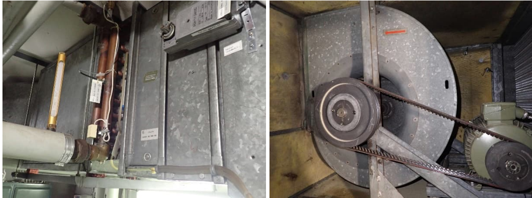
Kuvat 153 ja 154. Yleiskuvat tuloilmakoneesta TK01. Tuloilmapuhaltimen hihnaveto-osat olivat silmämääräisten havaintojen perusteella kuluneet. Puhallinkammion ja huoltoluukkujen pinnalla havaittiin harsopäälysteistä, mutta heikkokuntoista mineraalivillaa.
