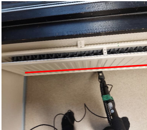
Kuva 48. Viereisen ryhmähuoneen B105b puolella todettiin myös ilmapuotopaikat alapohjan ja ulkoseinän liittymästä ryhmähuoneeseen B105a rajautuvan väliseinän läheisyydessä.
