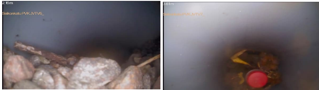
Kuva 185 ja 186. Vasemmassa kuvassa (JVTV6, KAT3) havaittu linjan romahdus, tai tulppaamaton linjan käytöstä poisto. Oikeassa kuvassa (JVTV7, KAT4) tuuletusviemärin pohjalla oleva juomapullo.
