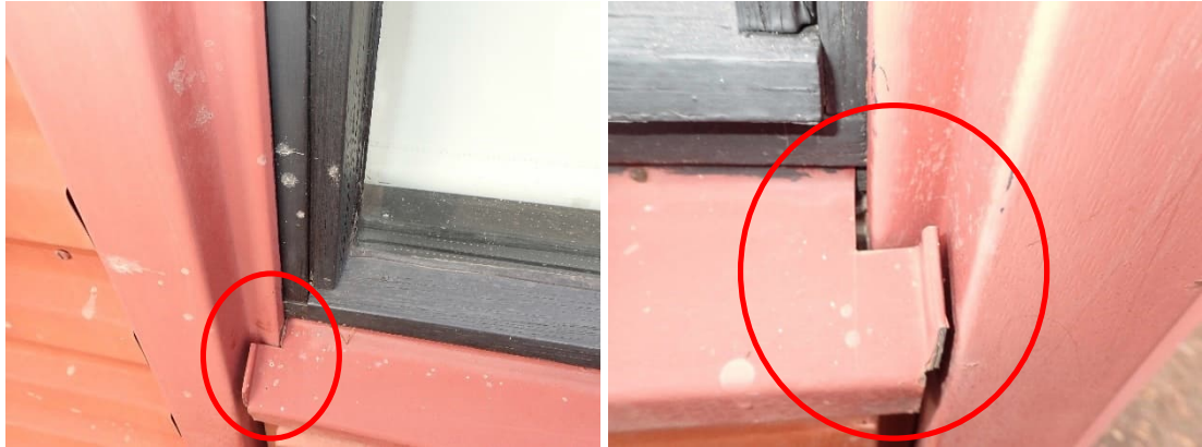
Kuvat 88 ja 89. Ikkunoiden vesipeltien reunat ovat epätiivit.
