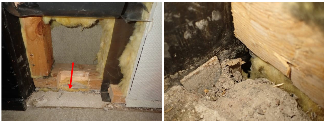
Kuvat 64 ja 65. Ryhmähuoneen A06 ulkoseinän alaosaan avaus R1. Sokkelihalkaisun kautta todettiin ilmapuotoja huonetilan suuntaan (nuoli). Mineraalivillassa todettiin mahdollista mikrobikasvustoa.
