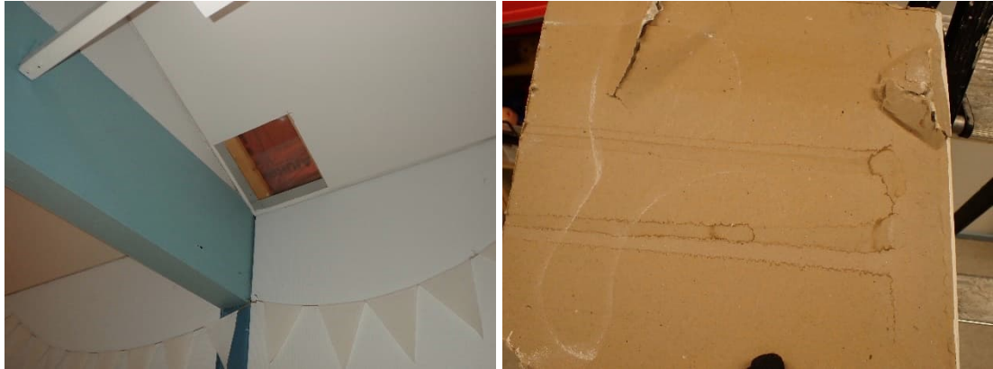
Kuvat 133 ja 134. Monitoimitilan C25 katon palkissa havaittiin kosteusjälkiä väliseinän vierellä. Vanhoja, nyt kuivia, kosteusjälkiä havaittiin myös kipsilevyssä ja höyrynsulkumuovissa. Avauskohta R9.
