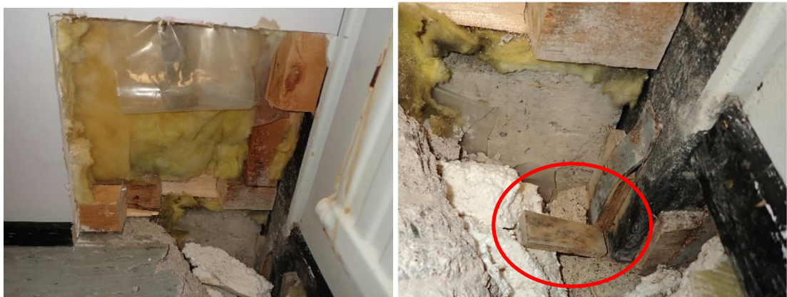
Kuvat 68 ja 69. Henkilökunnan taukotilan C05 ulkoseinän avaus R6 ja alapohjan avaus R29. Pilarin alapohjan sisällä olevan osuuden kosteus oli koholla ja pilaria vasten olevassa vanerissa oli näkyvää mikrobikasvua.
